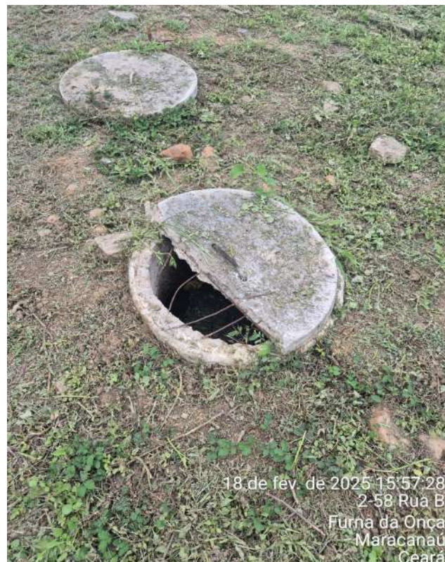
Foto 23 - ETE Nova Vida: tampas quebradas.
