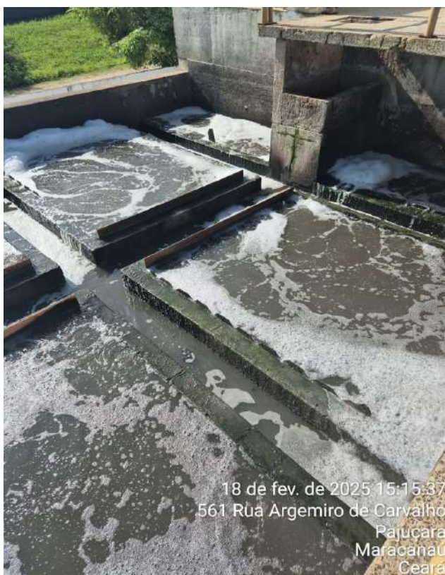
Foto 14 - ETE Pajuçara: armadura exposta, corrosão em toda sua estrutura e calhas desniveladas.
