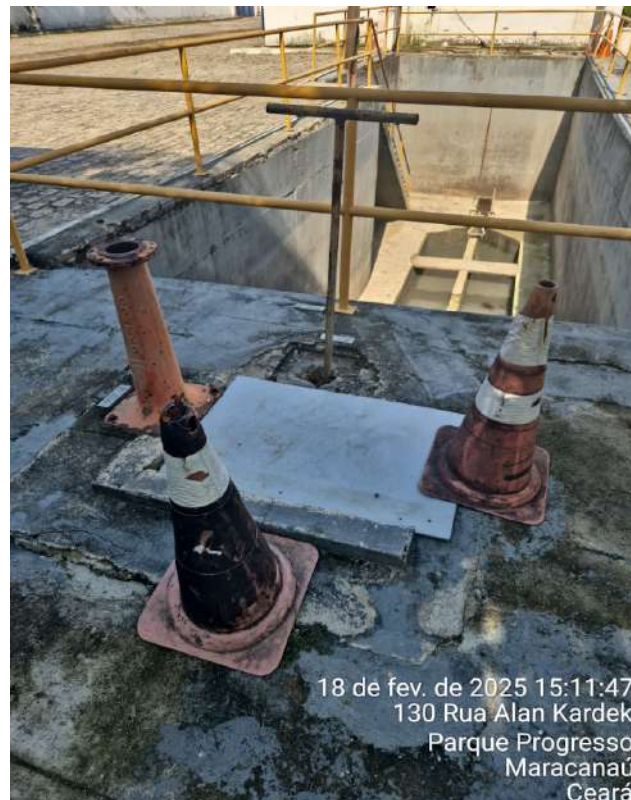
Foto 13 - ETE Pajuçara: corrosão nos acessos e armadura exposta em toda sua estrutura.
