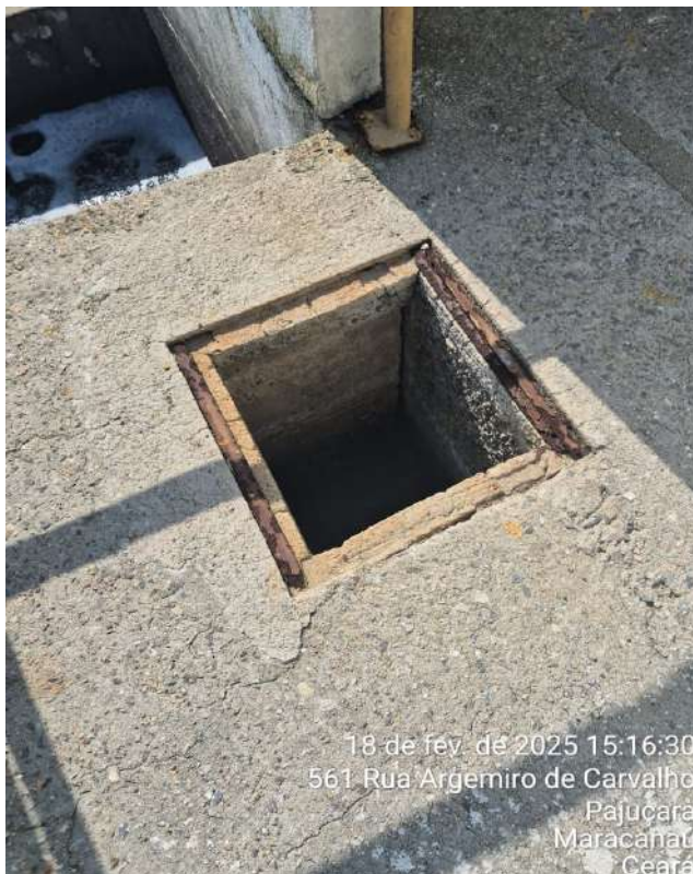
Foto 12 - ETE Pajuçara: armadura exposta em toda sua estrutura e ausência de tampas.
