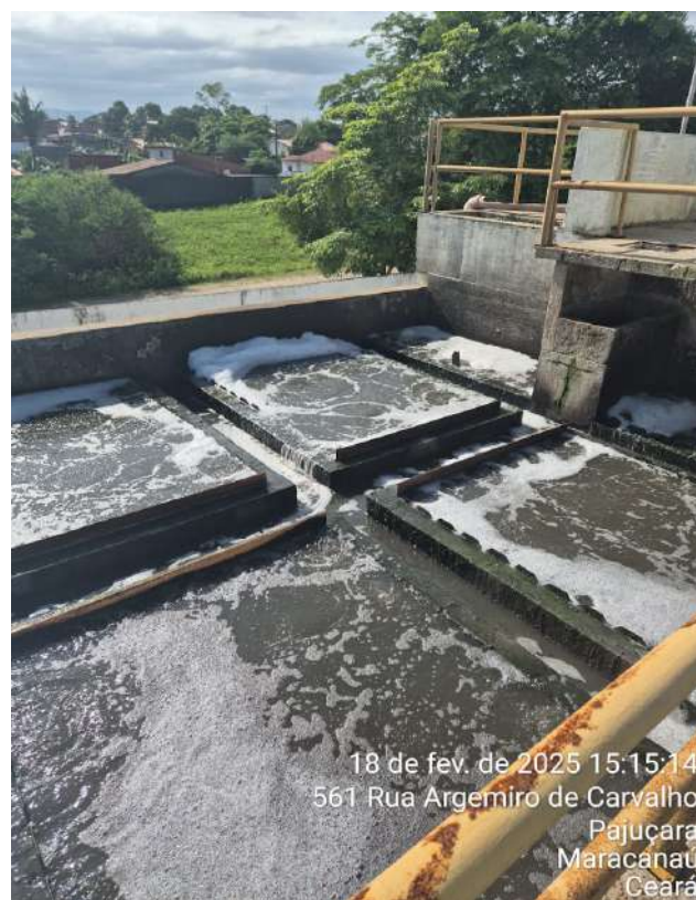
Foto 15 - ETE Pajuçara: armadura exposta, corrosão em toda sua estrutura e calhas desniveladas.
