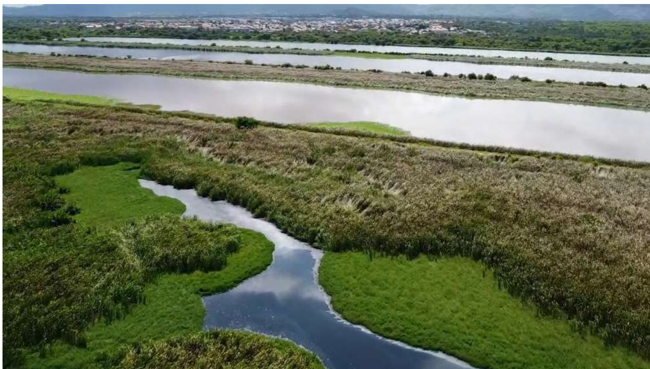
Foto 3 - ETE SIDI: Assoreamento completo, fluxos preferenciais, excesso de vegetação, acesso tomado pela vegetação, vegetação nas partes internas das lagoas e ausência de placas de proteção das lagoas de estabilização.
