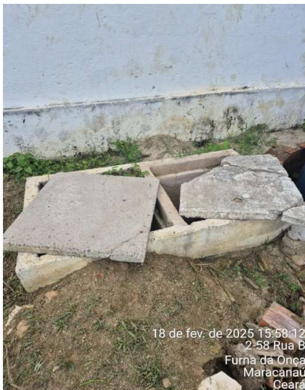
Foto 24 - ETE Nova Vida: tampas quebradas.
