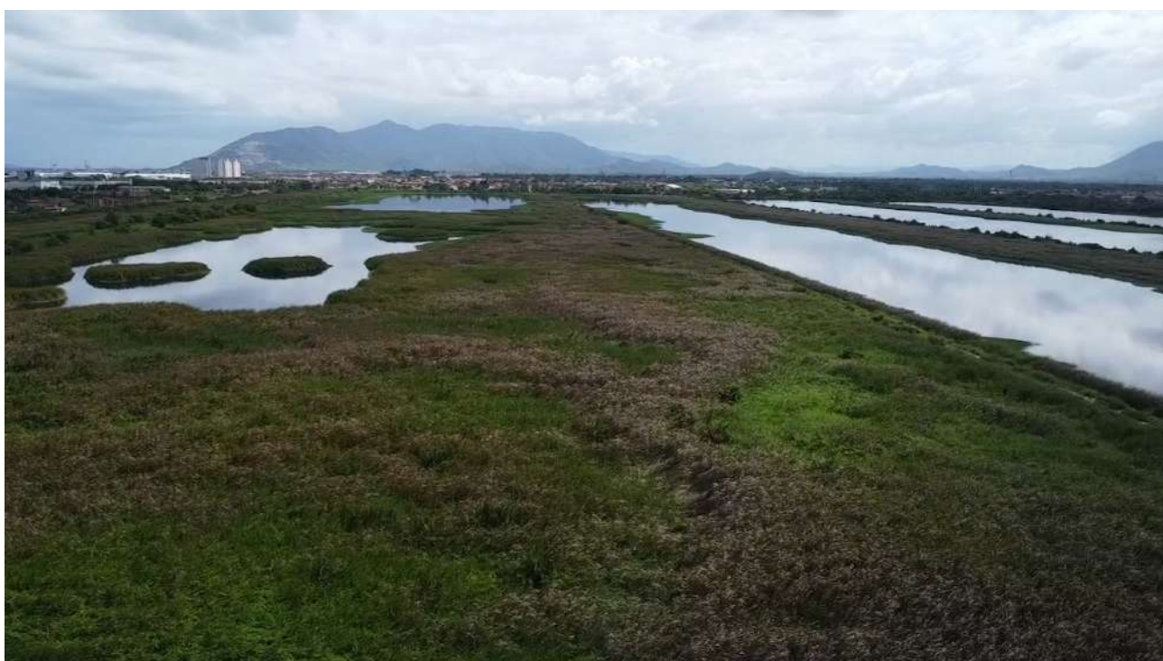
Foto 2 - ETE SIDI: Assoreamento completo, fluxos preferenciais, excesso de vegetação, acesso tomado pela vegetação, vegetação nas partes internas das lagoas e ausência de placas de proteção das lagoas de estabilização.
