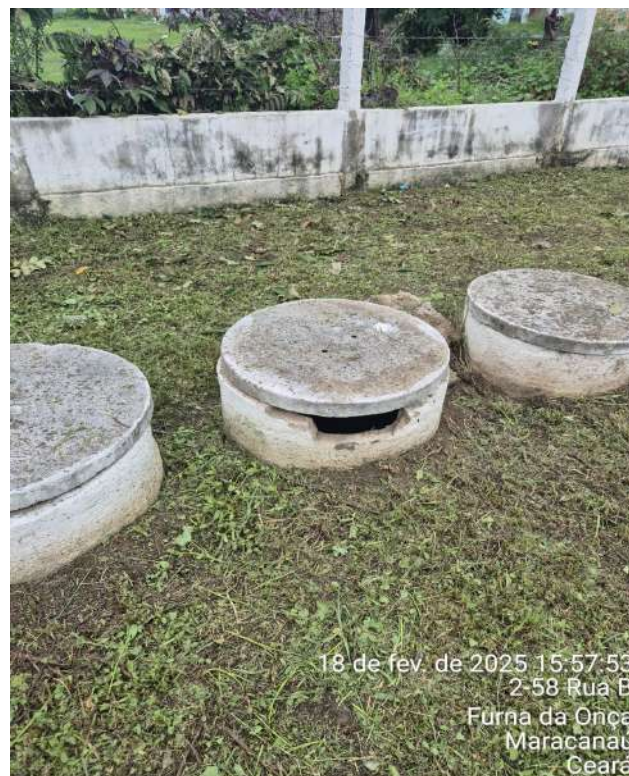
Foto 25 - ETE Nova Vida: tampas quebradas.
