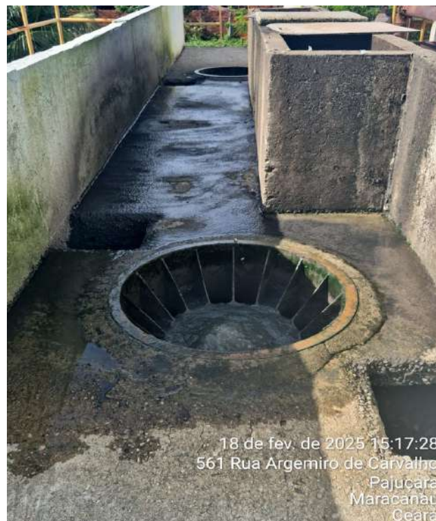
Foto 17 - ETE Pajuçara: Rosetas entupidas.
