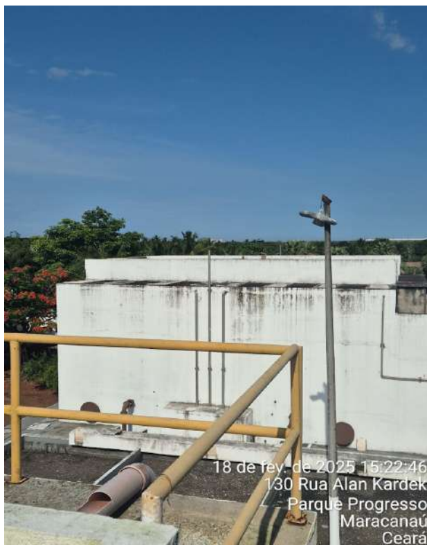
Foto 20 - ETE Pajuçara: módulo de tratamento inoperante.
