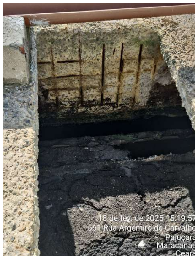
Foto 19 - ETE Pajuçara: corrosão nos acessos, armadura exposta em toda sua estrutura e lodo acumulado na superfície dos reatores.
