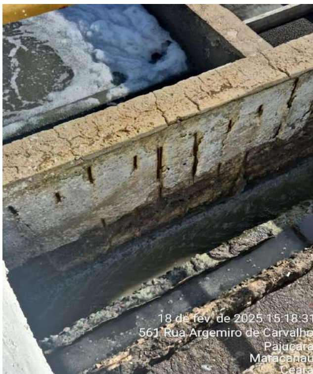
Foto 16 - ETE Pajuçara: corrosão nos acessos, armadura exposta em toda sua estrutura e lodo acumulado na superfície dos reatores.
