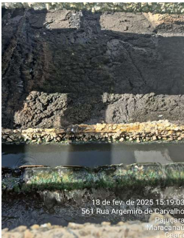
Foto 18 - ETE Pajuçara: corrosão nos acessos, armadura exposta em toda sua estrutura e lodo acumulado na superfície dos reatores.
