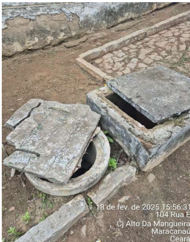
Foto 22 - ETE Nova Vida: tampas quebradas.
