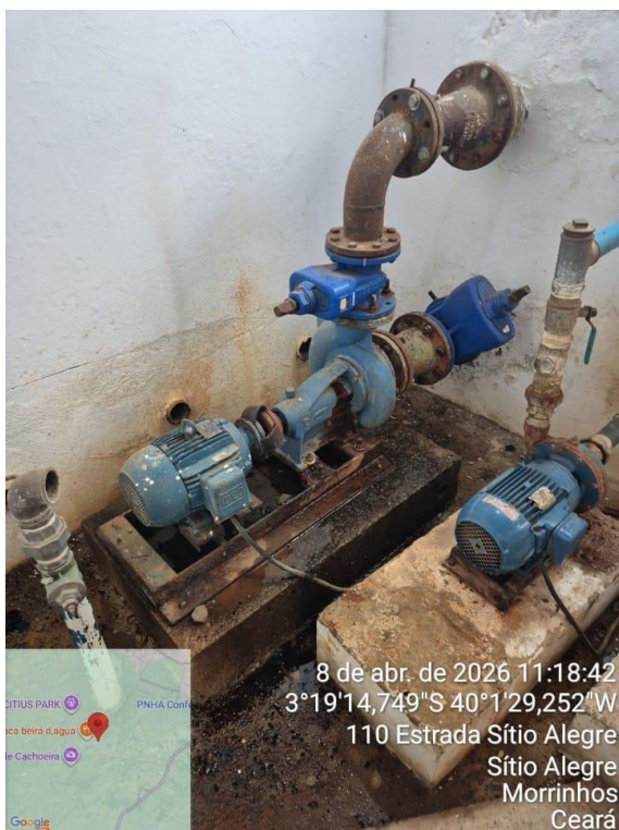
Foto 45 - ETA / EEAT-02 (Sítio Alegre): piso com acúmulo de água e sujeira.
