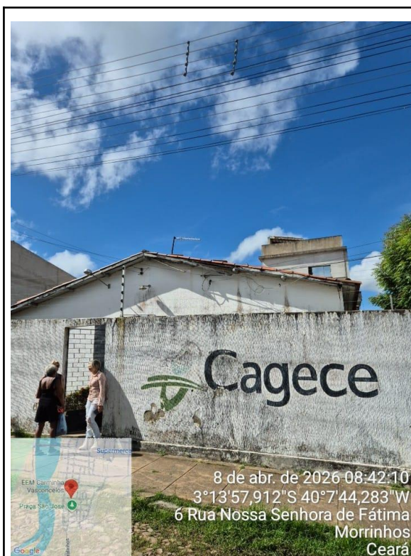
Foto 19 - Núcleo Operacional ( Sede ): pintura do muro externo desgastado e presença de cupim
