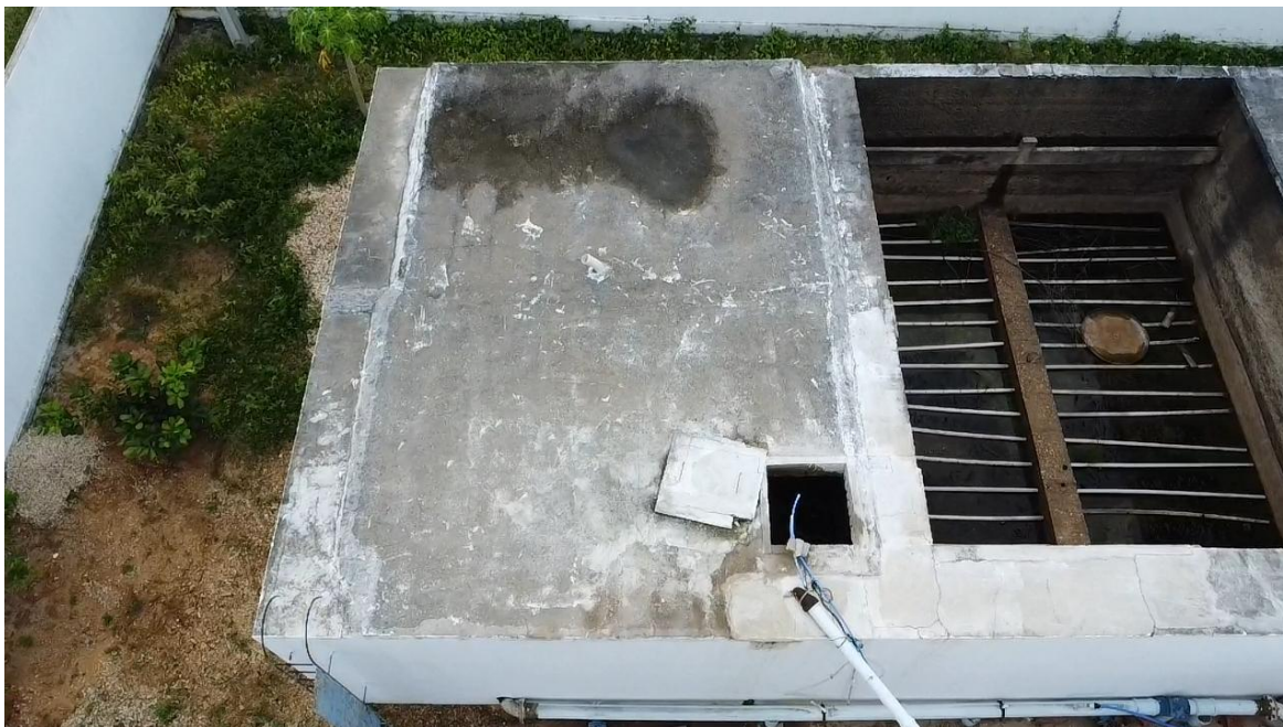
Foto 40 - RAP-02 (Sítio Alegre): tampa deslocada; rachadura na laje e nas laterais.
