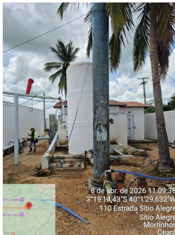
Foto 37 - Torre de Nível (Sítio Alegre): pintura deteriorada.
