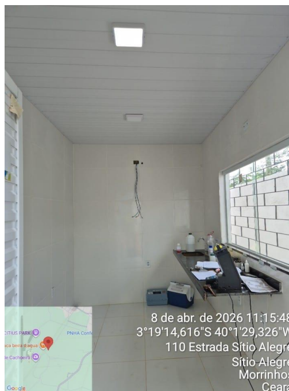
Foto 39 - ETA / Laboratório (Sítio Alegre): carência de armários para armazenagem de materiais e equipamentos, ocupando e sobrecarregando a bancada de trabalho.
