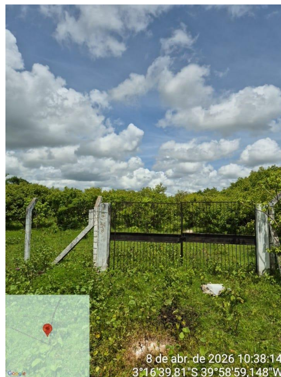
Foto 46 - RAP-03 / PT-03 / EEAT-03 (Sítio Alegre): área com portão de acesso danificado, excesso de vegetação.
