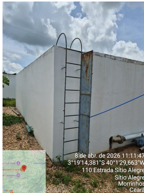
Foto 15 - ETA / RAP-02 (Sítio Alegre): escada inadequada, sem gaiola e grade de proteção acima do patamar superior / laje de cobertura.
