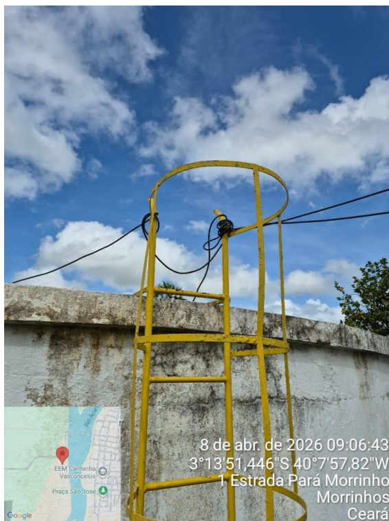
Foto 7 - ETA / RAP-01 (Sede): fiação inadequada, fixada na escada.
