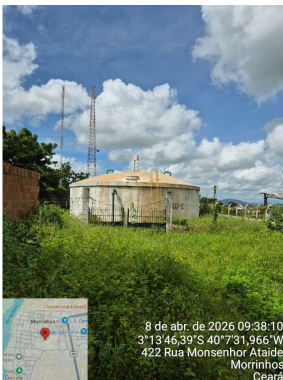
Foto 31 - RAP-02 (Sede): pintura desgastada; excesso de vegetação, dificultando o acesso ao reservatório.
