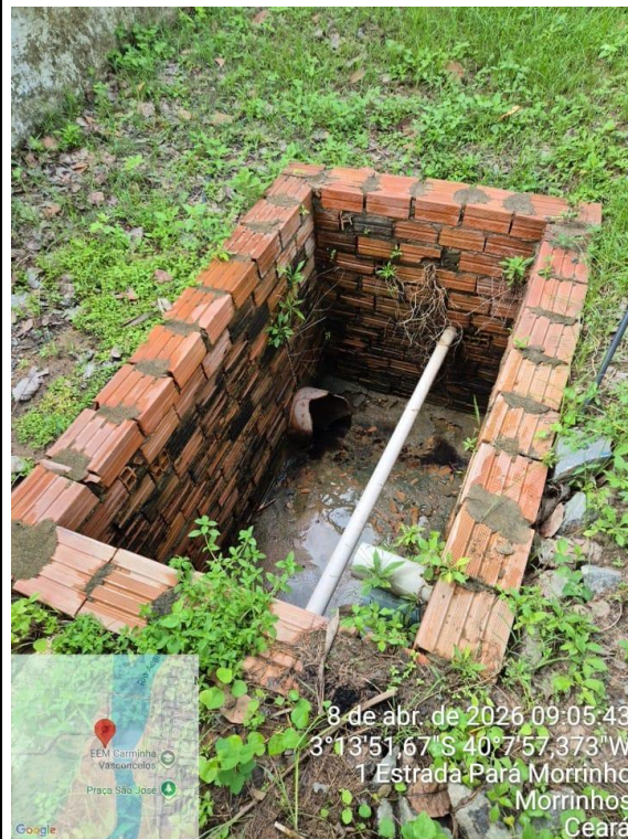
Foto 4 - ETA / Pátio (Sede): caixa inacabada sem tampa ou grade de proteção
