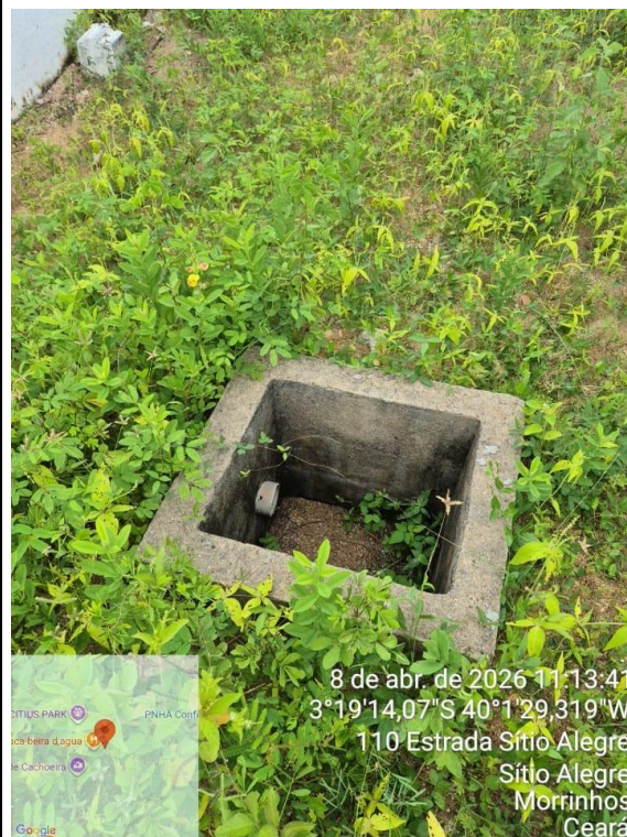
Foto 13 - ETA / Geral (Sítio Alegre): caixa sem tampa.
