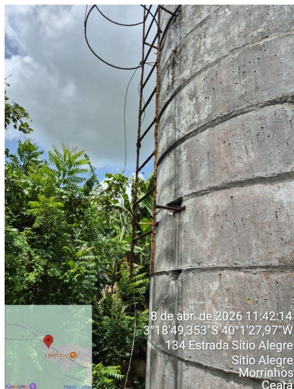
Foto 65 - REL-02 (Sítio Alegre): escada oxidada e danificada, com partes sem fixação.
