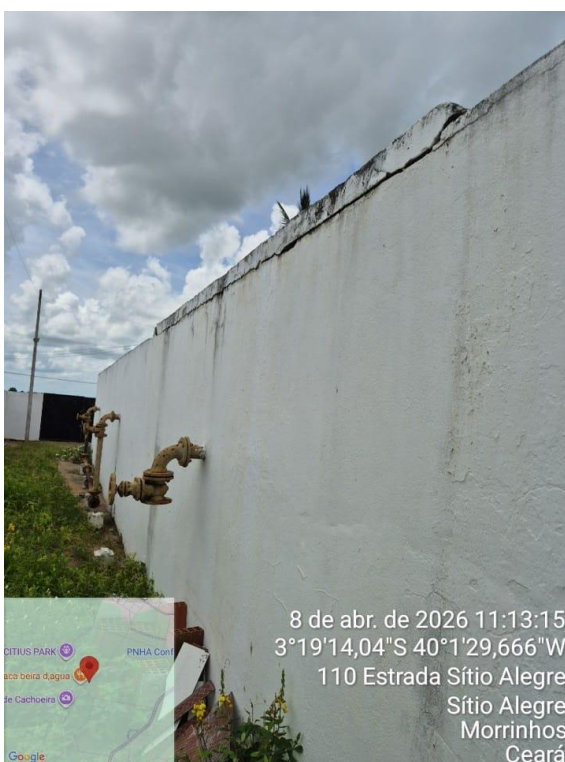
Foto 41 - ETA / RAP-02 (Sítio Alegre): rachadura na laje e nas laterais.
