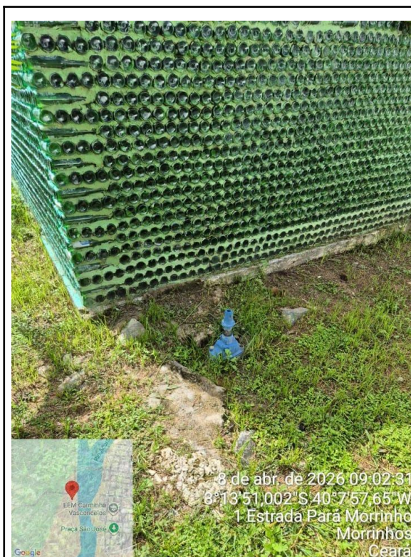
Foto 1 - ETA / Pátio ( Sede ): registro sem caixa de proteção.
