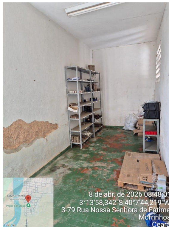
Foto 22 - Núcleo Operacional / Almoxarifado (Sede): reboco da parede danificado e piso desgastado
