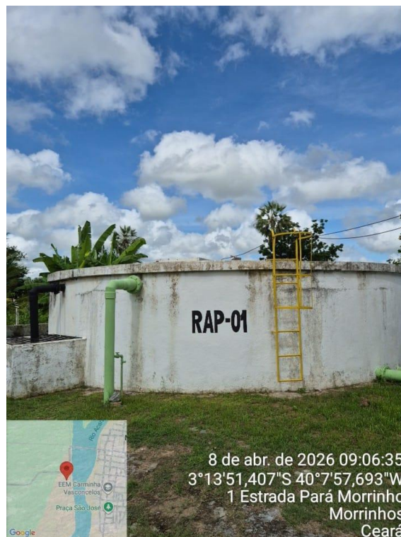
Foto 30 - ETA / RAP-01 (Sede): pintura desgastada.
