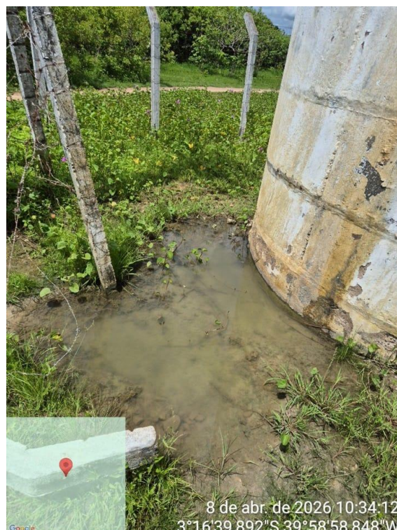
Foto 50 - RAP-03 / PT-03 / EEAT-03 (Sítio Alegre): presença de vazamento no RAP-03.
