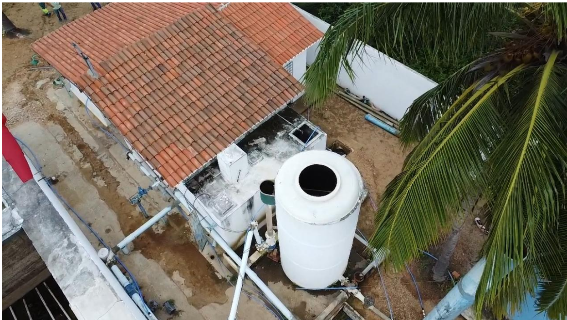
Foto 69 - ETA / RAP-01 (Sítio Alegre): estrutura desativada.
