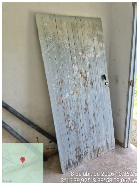
Foto 57 - RAP-03 / PT-03 / EEAT-03 (Sítio Alegre): pós-cloração com porta danificada.
