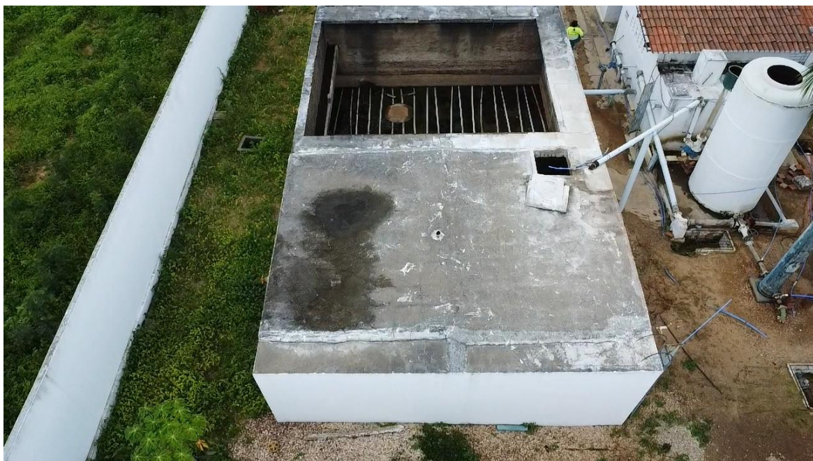
Foto 16 - ETA / RAP-02 (Sítio Alegre): escada inadequada, sem gaiola e grade de proteção acima do patamar superior / laje de cobertura.
