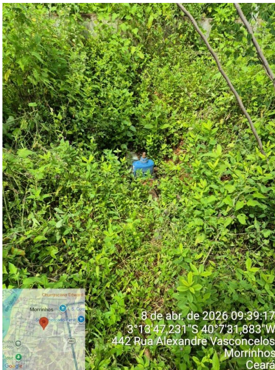
Foto 10- RAP-02 (Sede): registro sem caixa de proteção.
