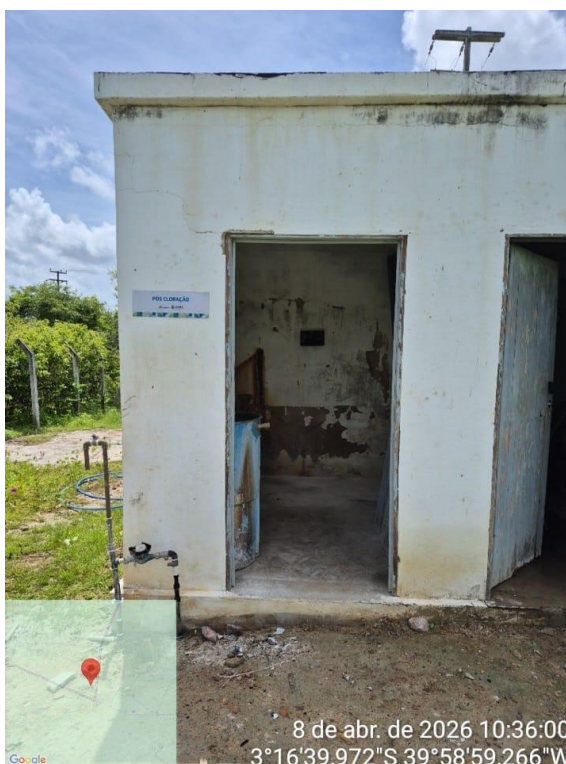
Foto 56 - RAP-03 / PT-03 / EEAT-03 (Sítio Alegre): pós-cloração com pintura deteriorada e porta danificada.
