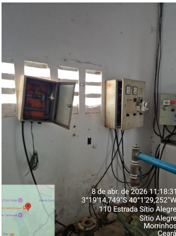
Foto 43 - ETA / EELF-01 (Sítio Alegre): cabeamento inadequado e quadro de comando oxidado.
