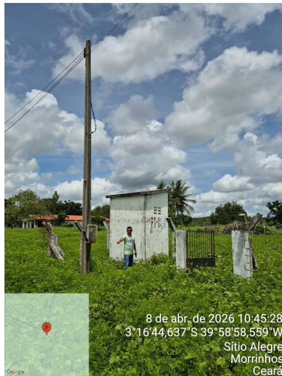
Foto 59 - PT-04 / Casa de comando (Sítio Alegre): excesso de vegetação; cerca danificada.
