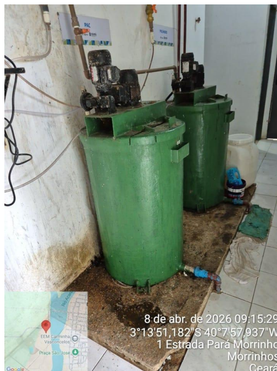
Foto 24 - ETA / Casa de química (Sede): pintura desgastada e sujeira; base dos recipientes sujas.
