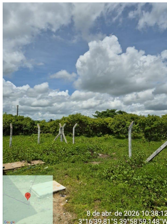
Foto 48 - RAP-03 / PT-03 / EEAT-03 (Sítio Alegre): área com cerca danificada em vários pontos.
