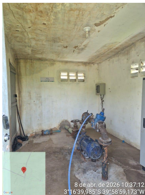
Foto 53 - RAP-03 / PT-03 / EEAT-03 (Sítio Alegre): EEAT-03 / Casa de Comando com pintura deteriorada; teto com rachaduras e infiltração e tubulação oxidada.
