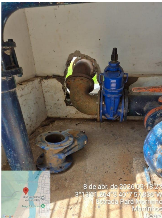
Foto 25 - ETA / Casa de Bombas (Sede): pintura desgastada.
