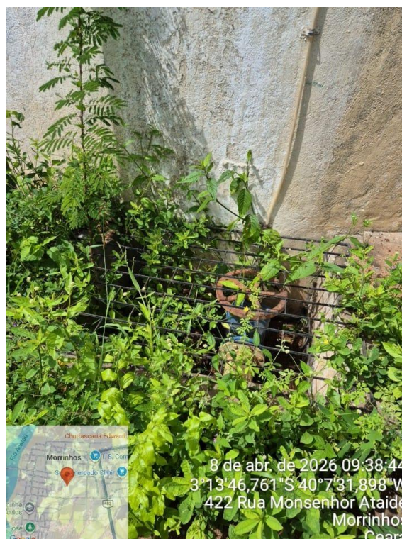
Foto 32 - RAP-02 (Sede): vegetação crescida na área e nas caixas de proteção e inspeção.
