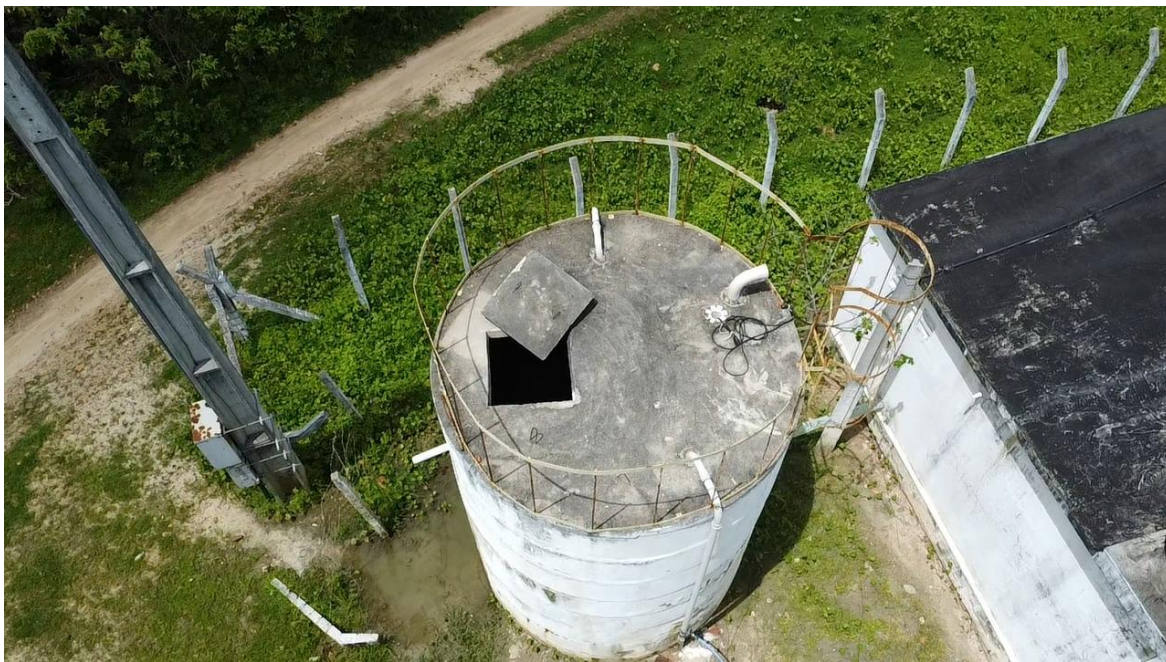
Foto 51 - RAP-03 / PT-03 / EEAT-03 (Sítio Alegre): RAP-03 com pintura deteriorada; escada oxidada; tampa deslocada.
