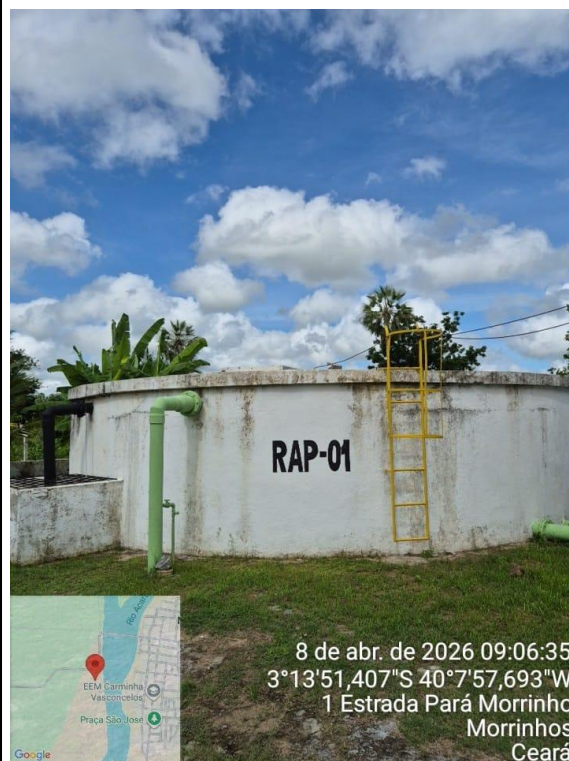
Foto 6 - ETA / RAP-01 (Sede): fiação inadequada, fixada na escada.
