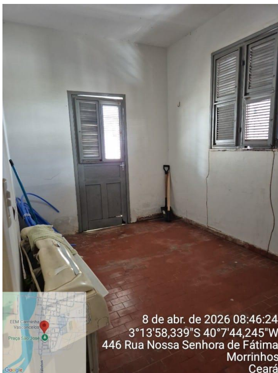
Foto 21 - Núcleo Operacional (Sede): presença de cupim.
