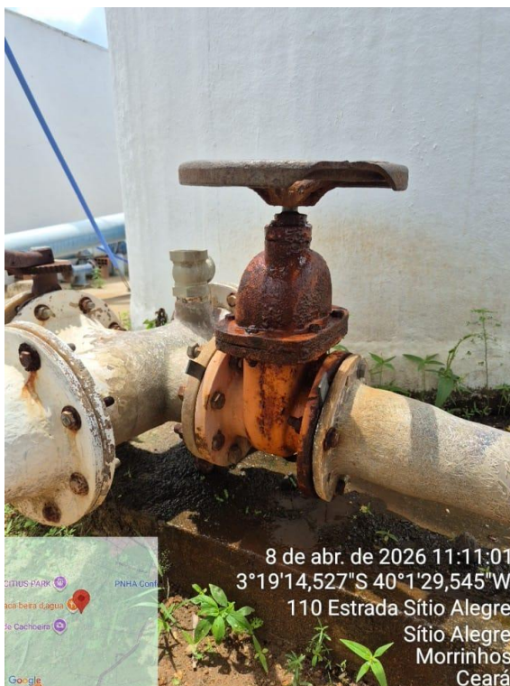
Foto 27 - ETA / Filtros (Sede): F-01 com vazamento no registro.
