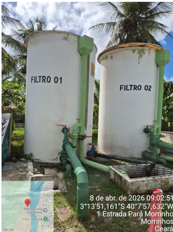
Foto 3 - ETA / Pátio (Sede): caixa de descarga sem tampa ou grade de proteção
