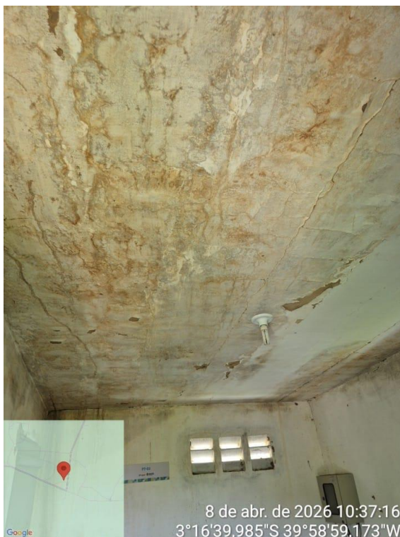
Foto 54 - RAP-03 / PT-03 / EEAT-03 (Sítio Alegre): EEAT-03 / Casa de Comando com pintura deteriorada; teto com rachaduras e infiltração e ausência de iluminação.
