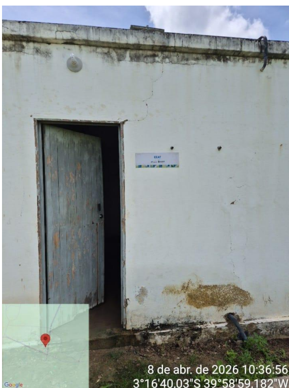
Foto 52 - RAP-03 / PT-03 / EEAT-03 (Sítio Alegre): EEAT-03 / Casa de Comando com pintura deteriorada.
