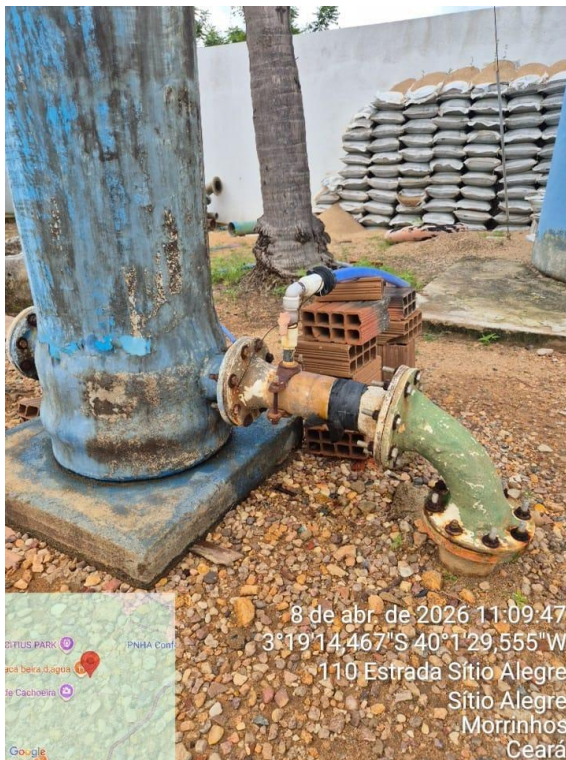
Foto 14 - ETA / Torre de Nível (Sítio Alegre): tijolos servindo como apoio.
