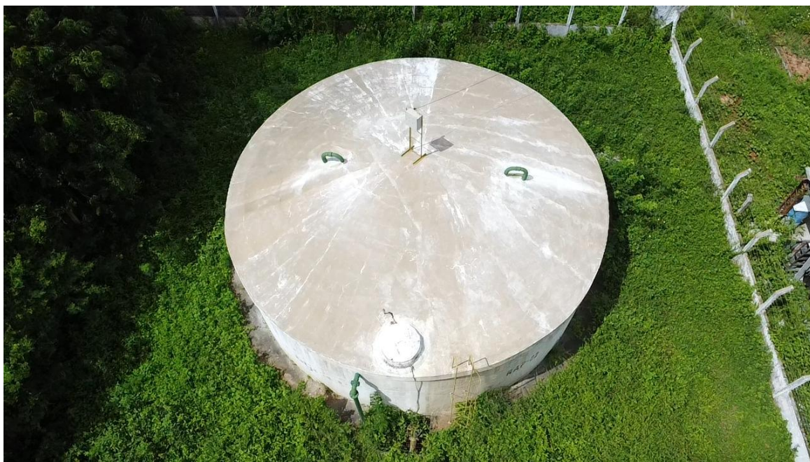
Foto 9 - REL-02 (Sede): não há grade de proteção acima do patamar superior / laje de cobertura.
