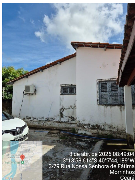
Foto 20 - Núcleo Operacional ( Sede ): pintura do muro externo desgastada.
