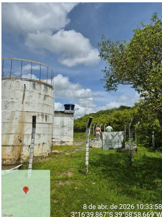
Foto 47 - RAP-03 / PT-03 / EEAT-03 (Sítio Alegre): área com cerca danificada em vários pontos.
