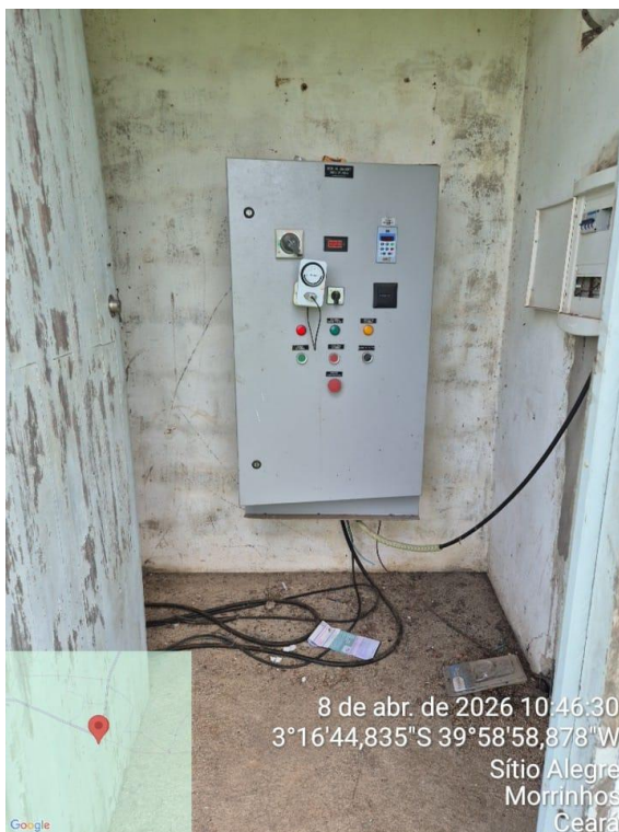
Foto 62 - PT-04 / Casa de comando (Sítio Alegre): pintura deteriorada; cabeamento inadequado.
