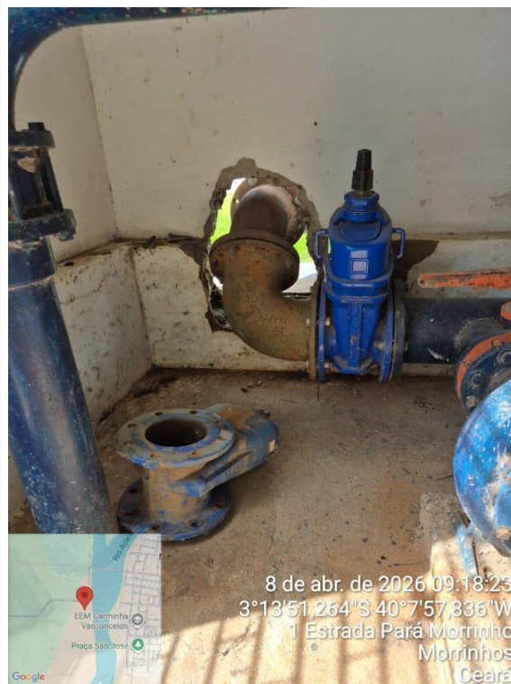
Foto 8 - ETA / Casa de Bombas (Sede): parede com buraco sem acabamento.
