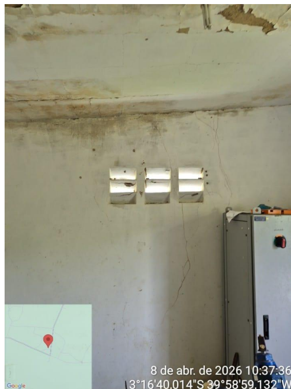
Foto 55 - RAP-03 / PT-03 / EEAT-03 (Sítio Alegre): EEAT-03 / Casa de Comando com pintura deteriorada; teto com rachaduras e infiltração.
