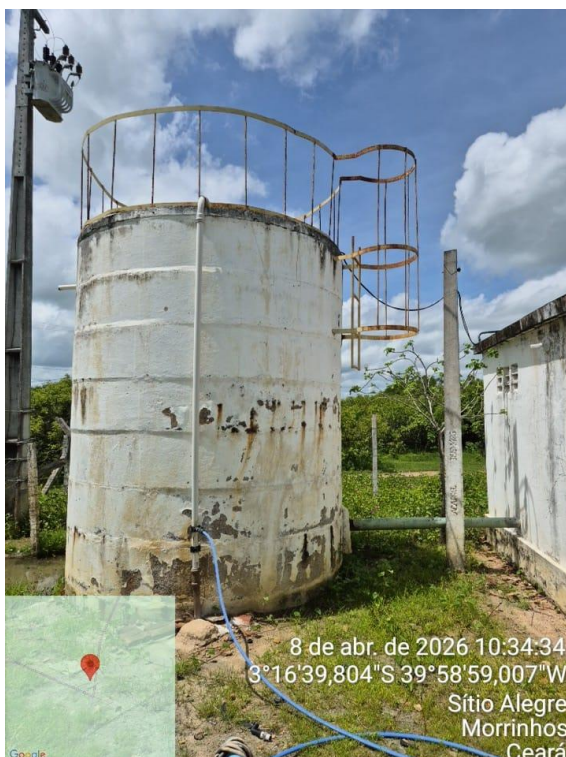
Foto 49 - RAP-03 / PT-03 / EEAT-03 (Sítio Alegre): RAP-03 com pintura deteriorada e escada oxidada.
