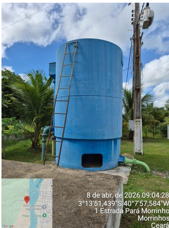
Foto 5 - ETA / F-03 (Sede): ausência de identificação e escada inadequada (sem fixação, gaiola e guarda corpo).
