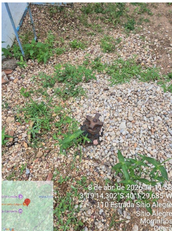
Foto 12 - ETA / Geral (Sítio Alegre): registro sem caixa de proteção.
