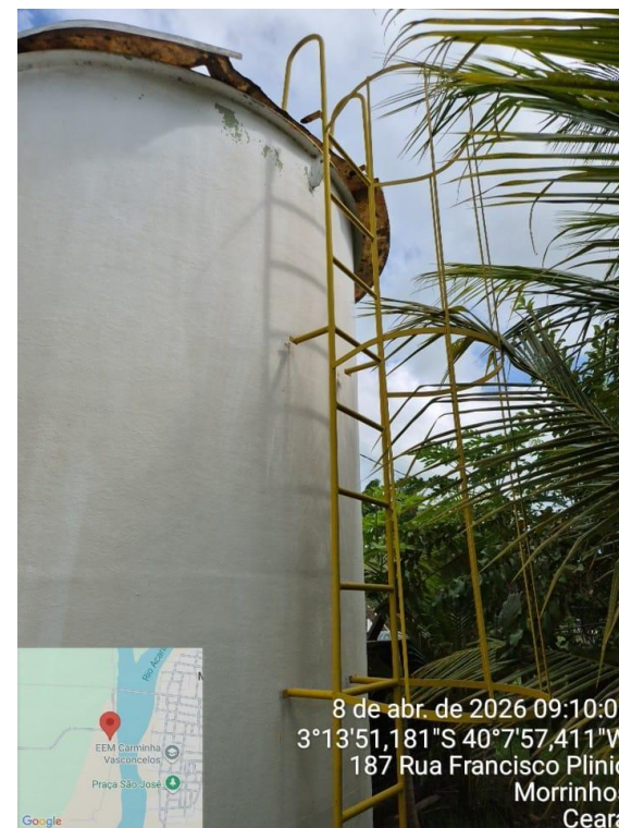
Foto 28 - ETA / Filtros (Sede): F-01 com escada sem fixação superior.
