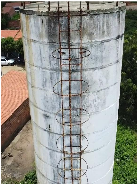
Foto 66 - REL-02 (Sítio Alegre): pintura deteriorada e escada oxidada.
