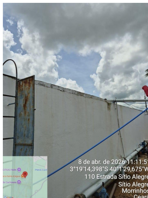
Foto 42 - ETA / RAP-02 (Sítio Alegre): rachadura na laje e nas laterais.
