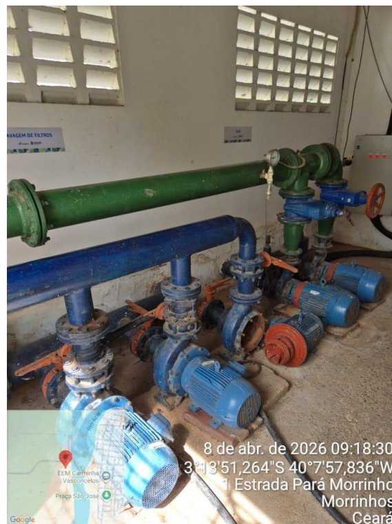
Foto 26 - ETA / Casa de Bombas (Sede): pintura desgastada barrilete com bomba desmontada.
