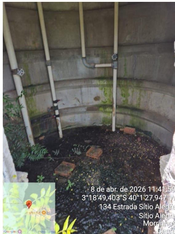
Foto 67 - REL-02 (Sítio Alegre): pintura deteriorada; área do fuste sem portão e com sujeidade.
