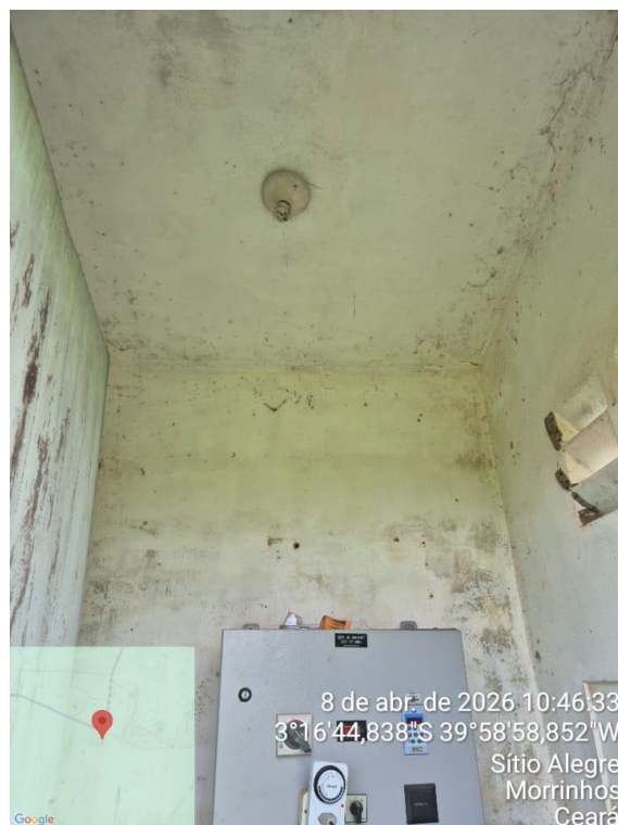
Foto 61 - PT-04 / Casa de comando (Sítio Alegre): pintura deteriorada e ausência de iluminação.
