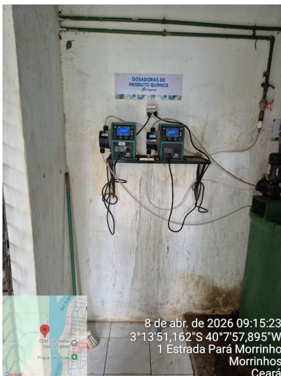
Foto 23 - ETA / Casa de química (Sede): pintura desgastada e sujeira.
