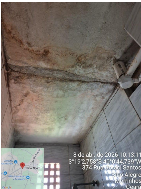
Foto 36 - Núcleo Operacional (Sítio Alegre): teto do banheiro com sinais de infiltração.
