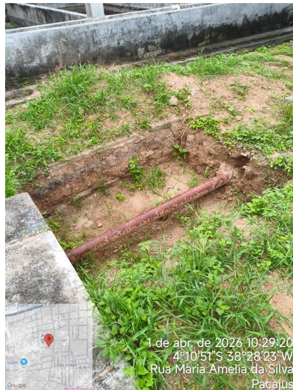
Foto 34 - ETE Parque Buriti: vala aberta com tubulação exposta.
