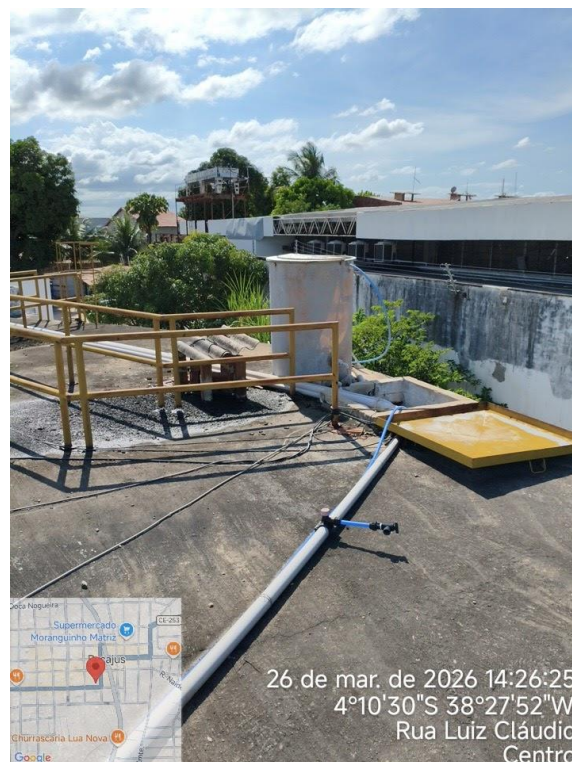
Foto 6 - RAP-06: fios e cabos instalados de maneira inadequada sobre a laje fixados ao corrimão metálico, sem eletroduto de proteção e isolamento.
