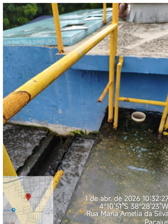
Foto 36 - ETE Parque Buriti: Reator com corrimão danificado e oxidado.
