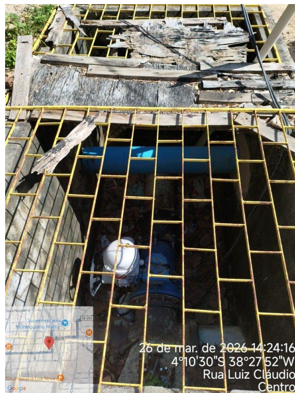
Foto 22 - Caixas de Inspeção: presença de material inadequado sobre a grade de proteção.
