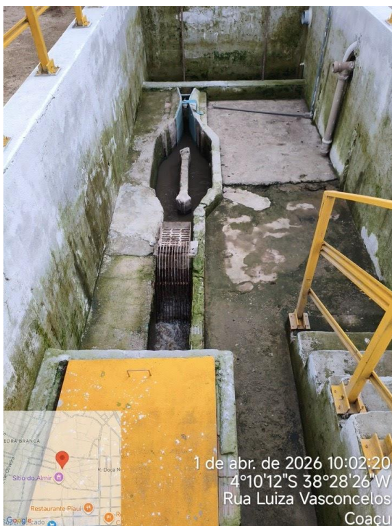
Foto 27 - ETE Geraldo Magela: tratamento preliminar com piso do fosso e da infraestrutura do canal dos esgotos deteriorados.
