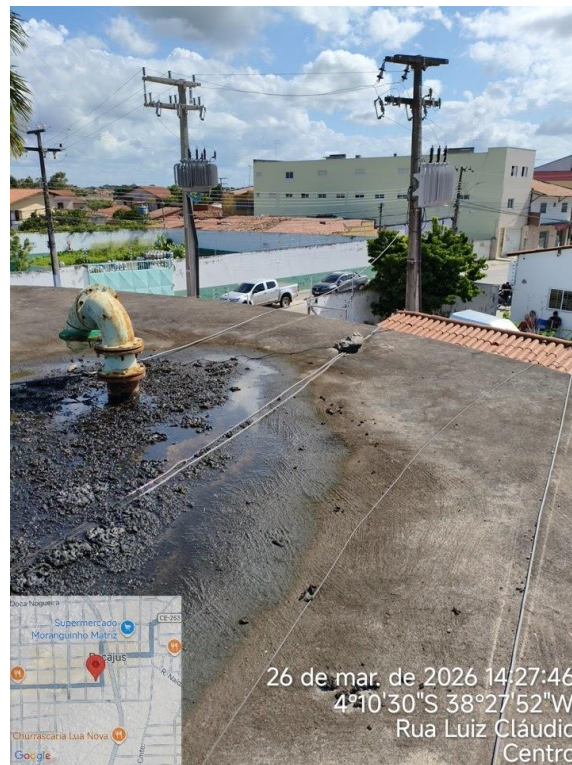
Foto 8 - RAP-06: furo na laje e fios e cabos instalados de maneira inadequada sobre a laje, sem eletroduto de proteção e isolamento.
