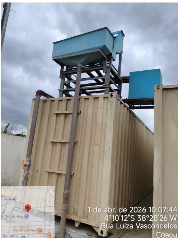
Foto 9 - ETE Geraldo Magela: não tem escada de acesso tipo marinheiro e nem plataforma de segurança para realização de atividades de operação e manutenção seguras.
