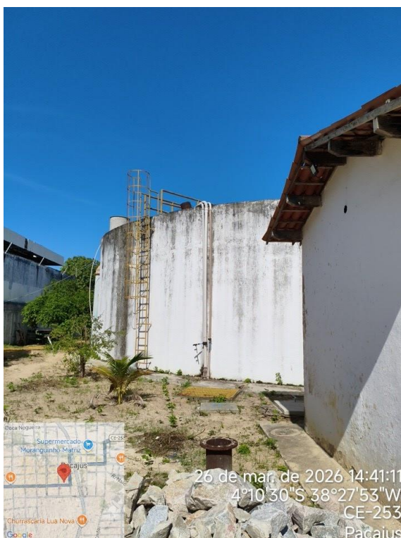
Foto 23 - RAP-06: pintura deteriorada.
