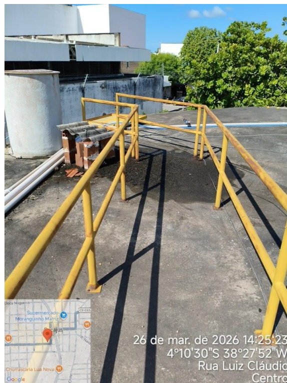
Foto 26 - RAP-06: acúmulo de sujeira (lodo) na laje.
