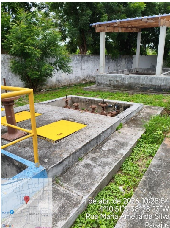
Foto 13 - ETE Parque Buriti: caixa proteção e inspeção sem tampa na área do pátio.
