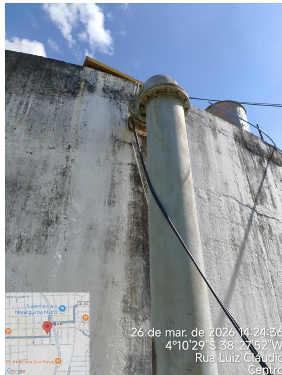
Foto 4 - RAP-06: instalações elétricas inadequadas, junto à tubulação metálica, sem eletroduto de proteção e isolamento.
