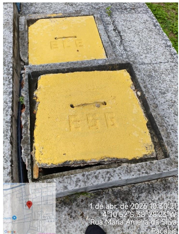
Foto 32 - ETE Parque Buriti: caixas inspeção com tampas em processo de degradação ou fora do lugar na área do pátio.
