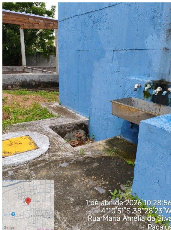
Foto 14 - ETE Parque Buriti: caixa de proteção inspeção sem tampa na área do pátio.
