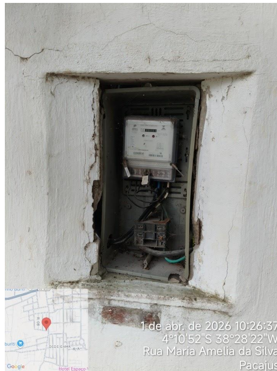
Foto 12 - ETE Parque Buriti: quadro de energia sem tampa, totalmente exposto.
