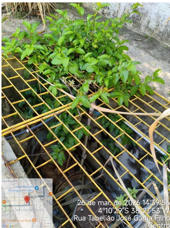
Foto 17 - Caixas de Inspeção: presença de vegetação alta.
