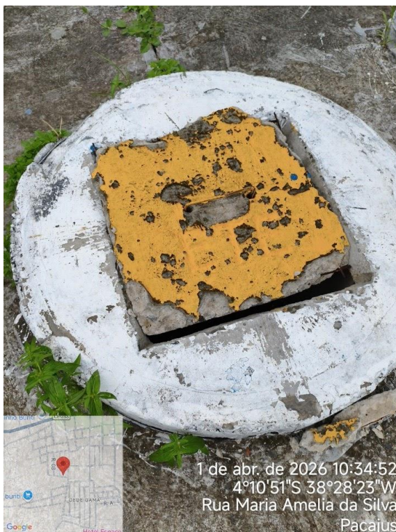
Foto 31 - ETE Parque Buriti: caixas inspeção com tampas em processo de degradação ou fora do lugar na área do pátio.
