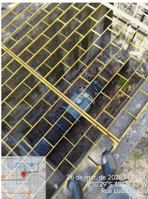
Foto 19 - Caixas de Inspeção: tubulação em processo de corrosão.
