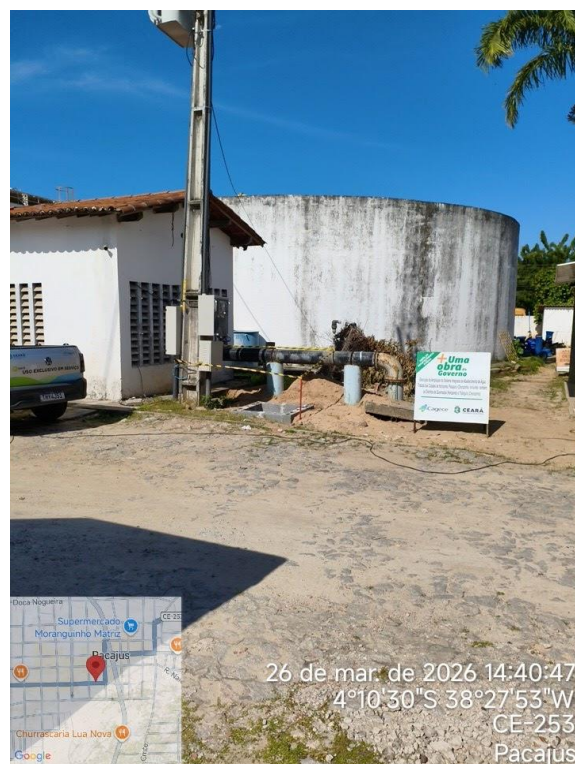
Foto 24 - RAP-06: pintura deteriorada.
