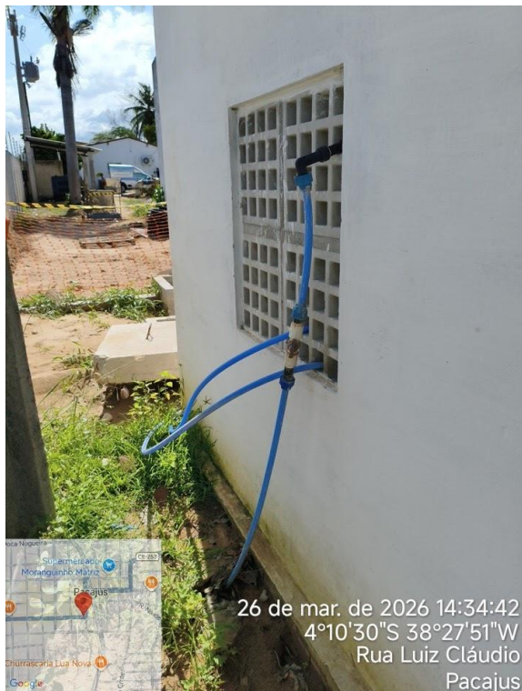
Foto 3 - Cloração: tubulação hidráulica instalada de maneira inadequada, através de cobogós.
