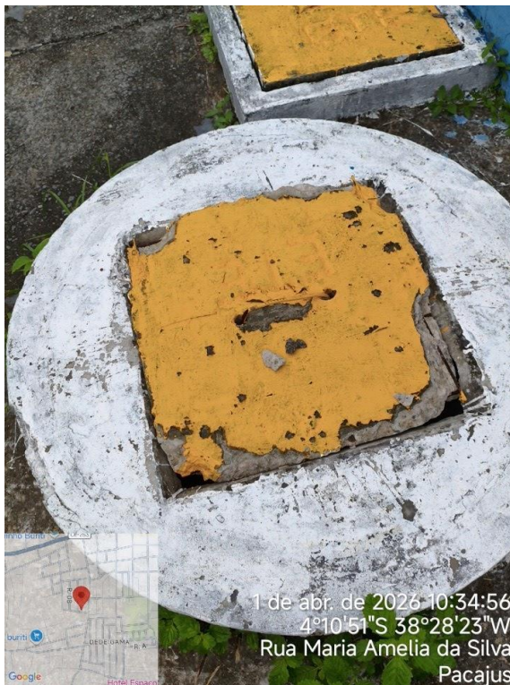
Foto 33 - ETE Parque Buriti: caixas inspeção com tampas em processo de degradação ou fora do lugar na área do pátio.
