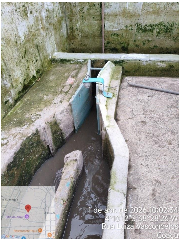
Foto 11 - ETE Geraldo Magela: tratamento preliminar não possui comportas de isolamento para manutenção das caixas de areia.
