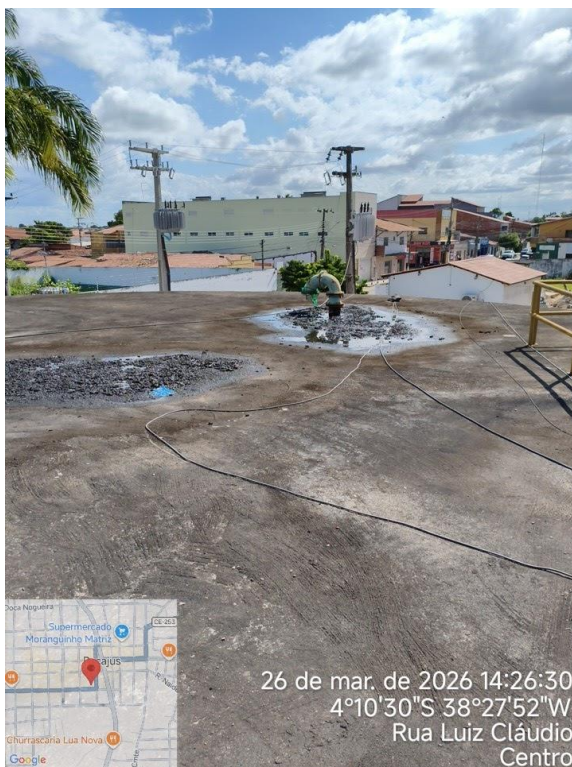
Foto 25 - RAP-06: acúmulo de sujeira (lodo) na laje.
