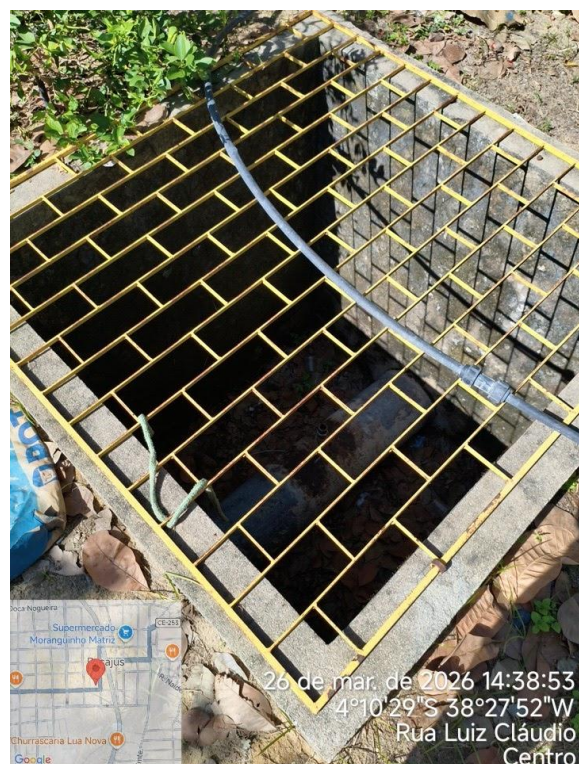
Foto 20 - Caixas de Inspeção: tubulação em processo de corrosão.
