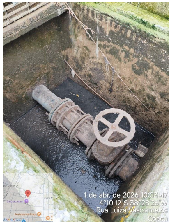
Foto 30 - ETE Geraldo Magela: tratamento preliminar com pintura das paredes do fosso deteriorada.
