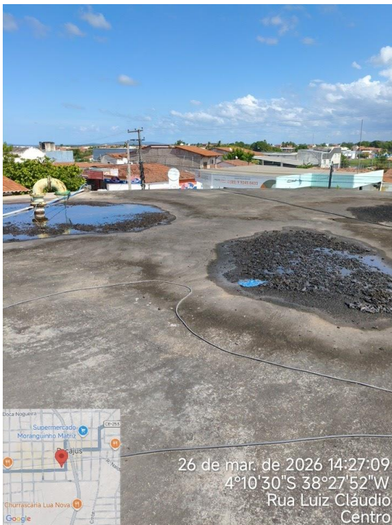
Foto 7 - RAP-06: fios e cabos instalados de maneira inadequada sobre a laje, sem eletroduto de proteção e isolamento.
