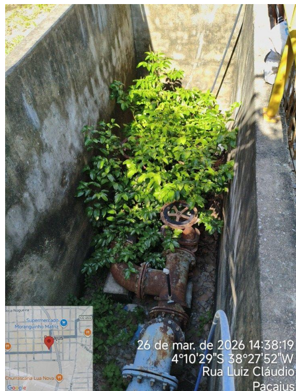
Foto 18 - Caixas de Inspeção: presença de vegetação alta e tubulação oxidada.
