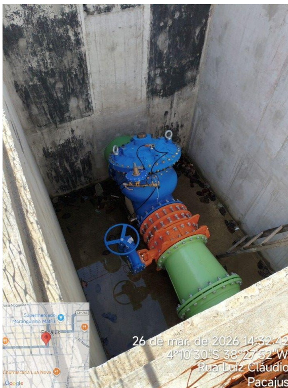
Foto 21 - Caixas de Inspeção: presença de água empoeada no interior.
