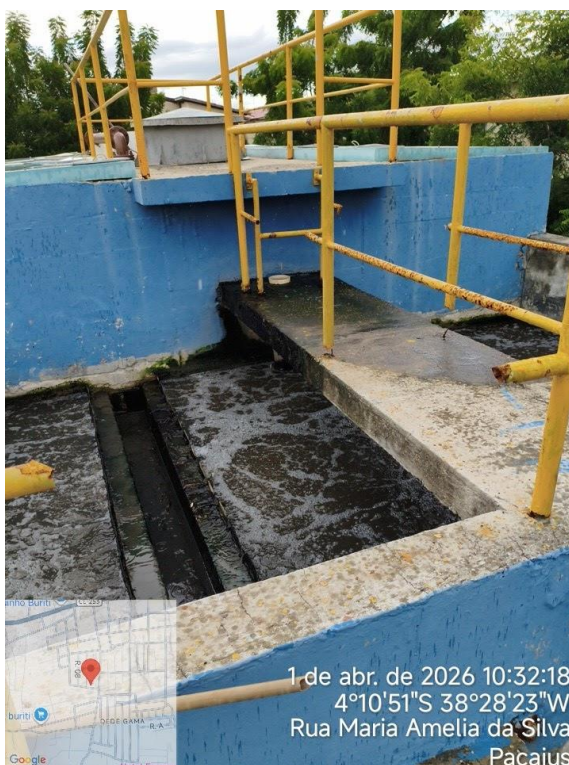
Foto 35 - ETE Parque Buriti: Reator com corrimão danificado e oxidado.
