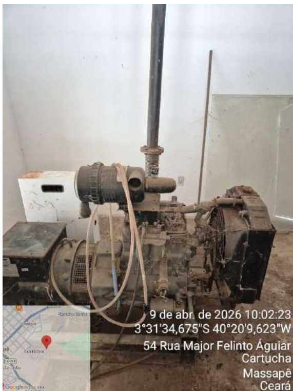
Foto 89 - EEE-02: Casa de bombas ausência de iluminação Gerador de energia com defeito, coberto por sujeira.
