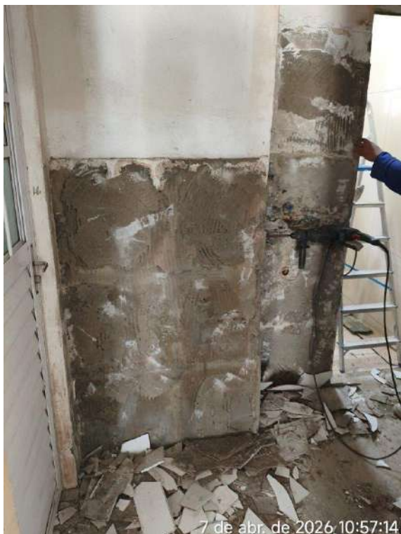
Foto 53 - Casa de Química / Cloração (Ipaguaçu): paredes deterioradas.
