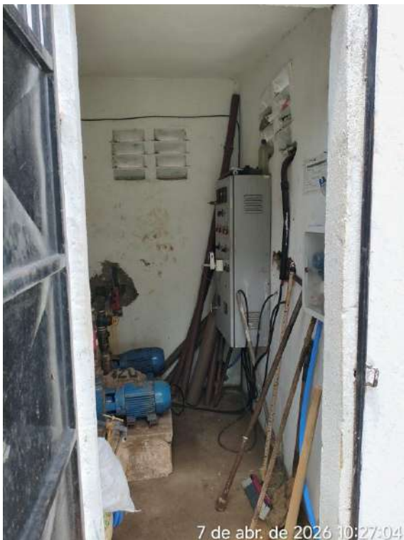
Foto 31 - EEAT-05 (Mumbaba): instalações elétricas sem eletroduto e isolamento de proteção e ausência de iluminação.
