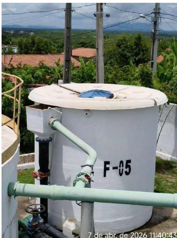
Foto 9 - ETA / Filtros (Ipaguaçu): F-05 não tem escada de acesso; caixa de saída de água sem tampa.
