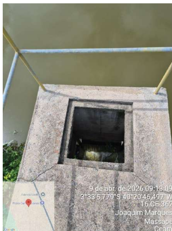
Foto 38 - ETE Massapê: caixas de passagem sem tampa.
