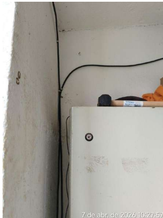
Foto 32 - EEAT-05 (Mumbaba): instalações elétricas sem eletroduto e isolamento de proteção.
