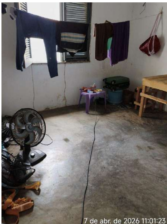
Foto 51 - Casa do operador (Ipaguaçu): infraestrutura servindo de depósito de materiais e equipamentos, sem organização e controle..
