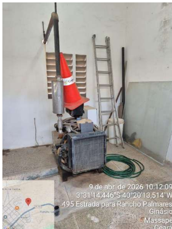
Foto 86 - EEE-01: grupo-gerador inoperante.
