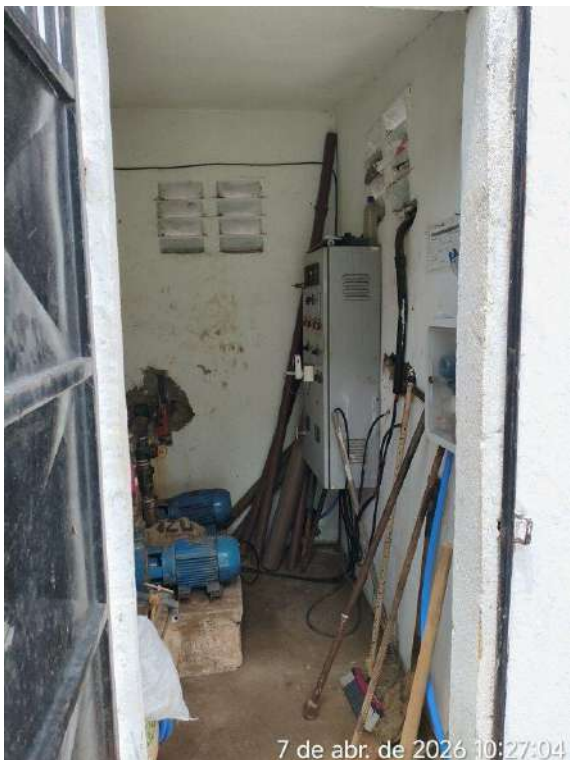
Foto 74 - EEAT-05 (Mumbaba): pintura e paredes deterioradas, com buracos e área ocupada por material armazenado.
