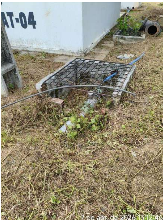
Foto 57 - Pátio (Massapê): caixa de proteção e inspeção deteriorada e com mato crescendo em seu interior.
