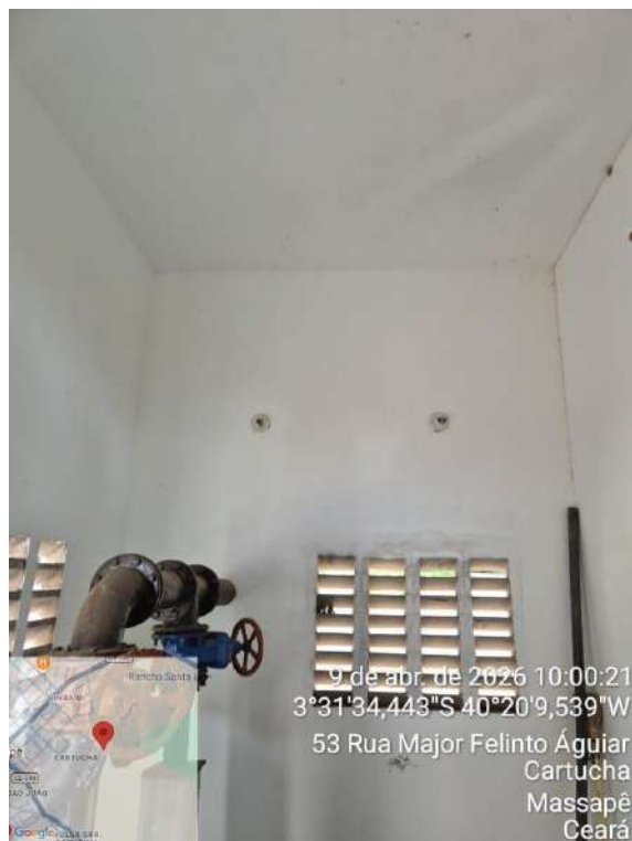
Foto 90 - EEE-02: Casa de bombas ausência de iluminação.
