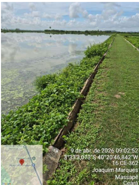
Foto 79 - ETE Massapê: Lagoa facultativa/maturação com excesso de vegetação; meios-fios de danificados.
