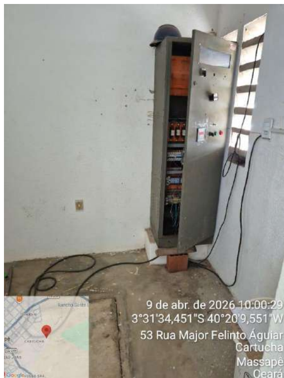
Foto 92 - EEE-02: Casa de bombas com fiação inadequada.
