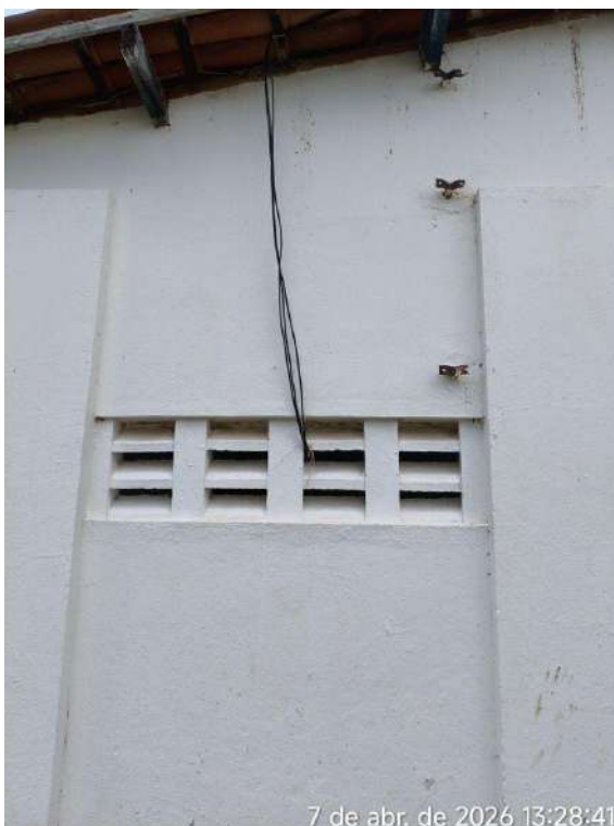
Foto 29 - EEAT-03 (Massapê): instalações elétricas sem eletroduto de isolamento e proteção, instalada através de cobogós.
