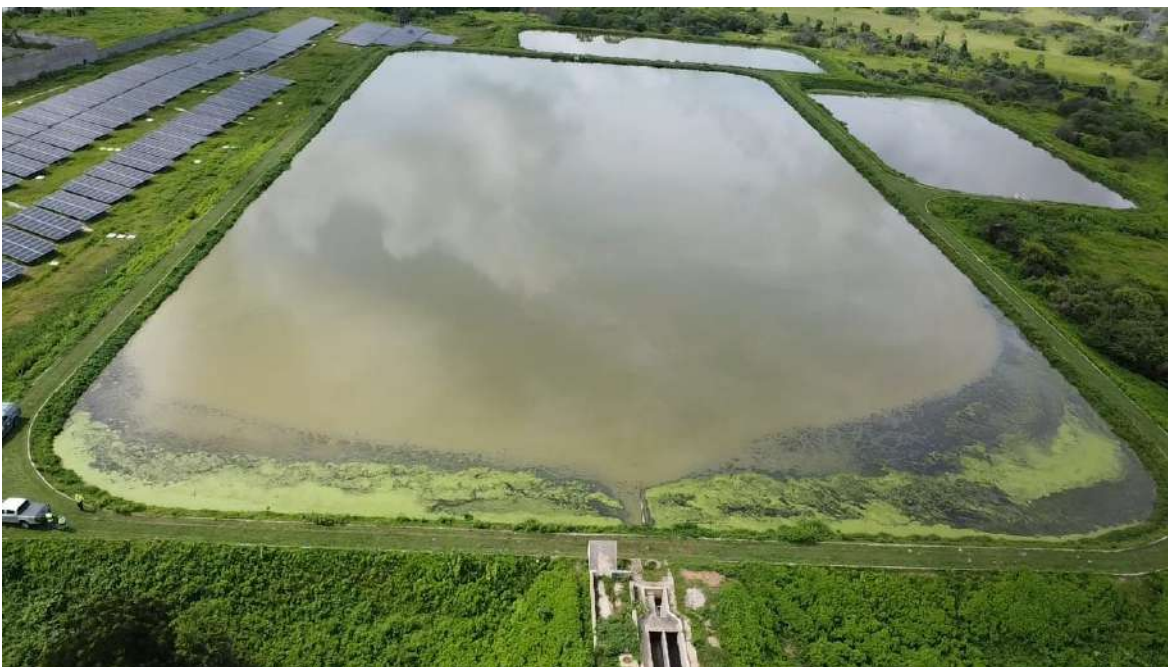
Foto 76 - ETE Massapê: Lagoa facultativa/maturação: excesso de vegetação no entorno, dificultando o acesso; presença de zonas mortas.
