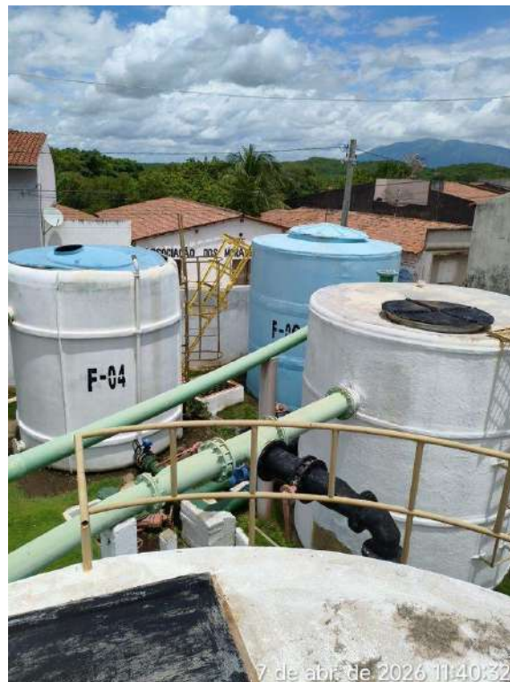
Foto 8 - ETA / Filtros (Ipaguaçu): F-04 com ausência de tampa.
