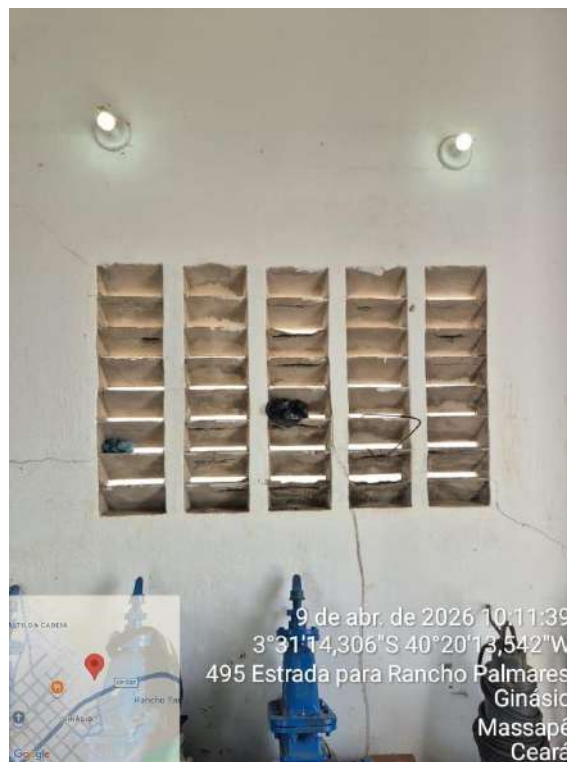
Foto 82 - EEE-01: Paredes com rachaduras e pinturas desgastadas.
