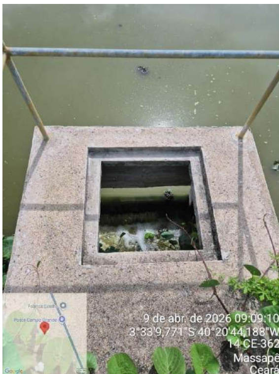
Foto 35 - ETE Massapê: caixas de passagem sem tampa.
