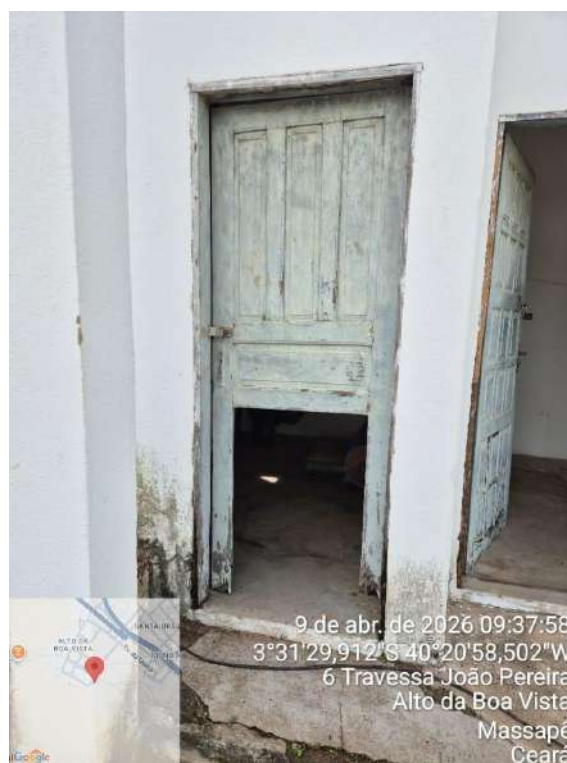
Foto 96 - EEE-03: Sala quadro de comando: porta quebrada.
