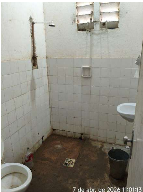
Foto 49 - Casa do operador (Ipaguaçu): banheiro em estado precário, com dispositivos que não funcionam e sujeidade.
