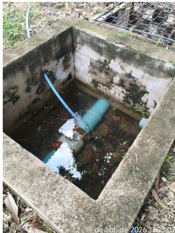
Foto 16 - Pátio (Massapê): caixas de inspeção e proteção sem tampa.
