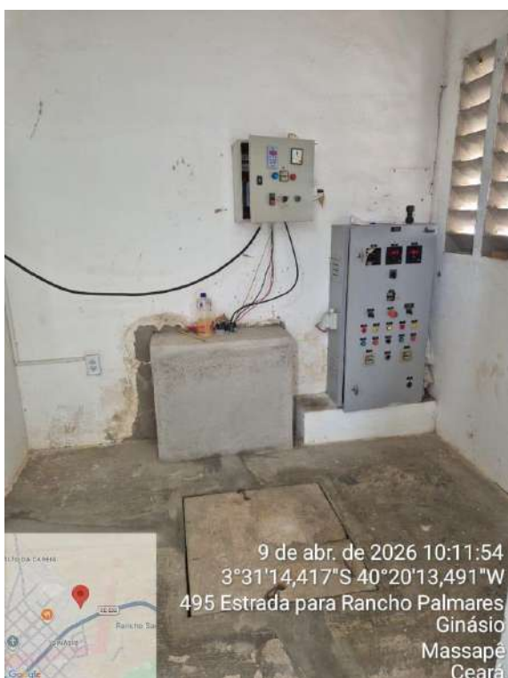
Foto 83 - EEE-01: Paredes com rachaduras e pinturas desgastadas.
