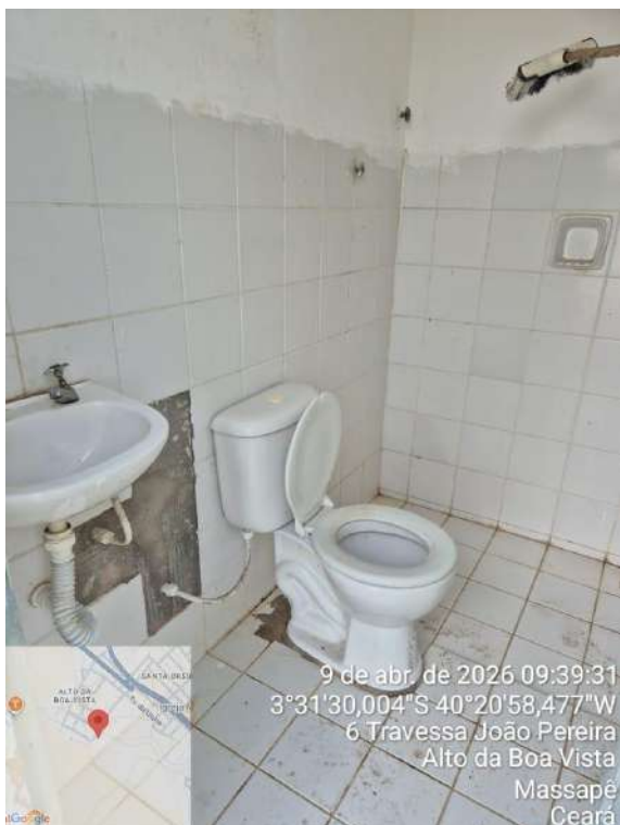
Foto 97 - EEE-03: banheiro com revestimento danificado, sem iluminação e com sujeira.
