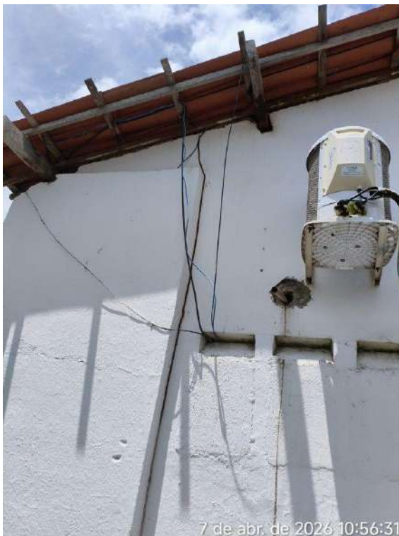
Foto 11 - ETA / Estações Elevatórias (Ipaguaçu): instalações elétricas das EEAT-01 e EEAT-02 implantadas através de combogó sem eletrodutos de proteção e isolamento.
