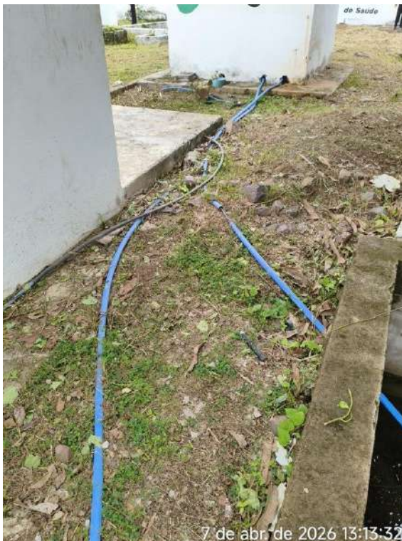
Foto 15 - Pátio (Massapê): instalações elétricas com eletrodutos danificados e expostos sobre solo em área de circulação.
