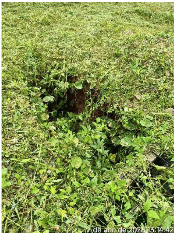
Foto 59 - Pátio (Massapê): caixa de proteção e inspeção com mato crescido em seu interior.
