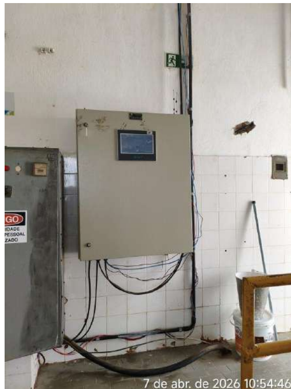
Foto 12 - ETA / Estações Elevatórias (Ipaguaçu): EEAT-01 e EEAT-02 com instalações elétricas sem eletrodutos de proteção e isolamento.
