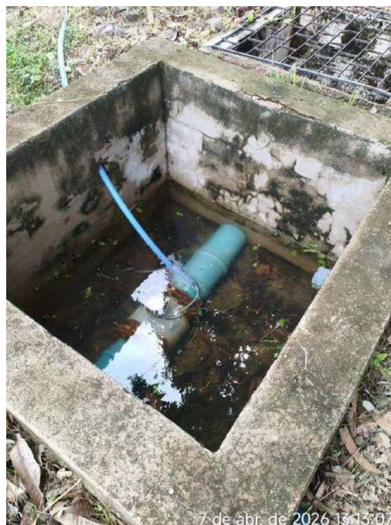
Foto 62 - REL-02 (Massapê): vazamento no tubo de descida de abastecimento para a cidade.
