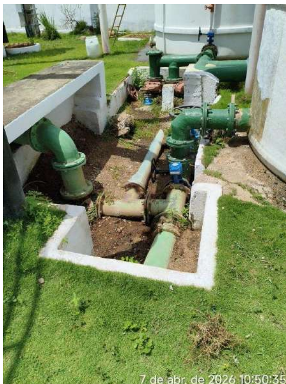
Foto 5 - ETA / Pátio (Ipaguaçu): caixas de saída de água na área do pátio sem tampa.
