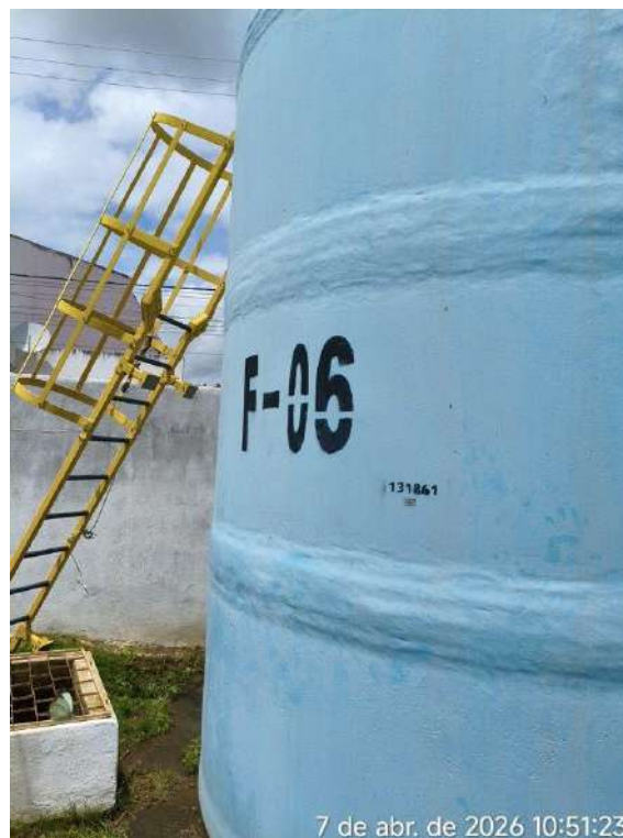
Foto 46 - F-06 (Ipaguaçu): a escada está danificada.
