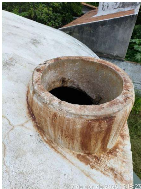
Foto 22 - RAP-02 (Massapê): abertura de inspeção sem tampa.
