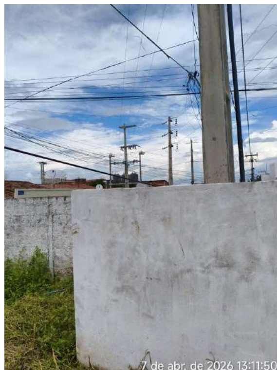
Foto 14 - Pátio (Massapê): instalações danificadas, emaranhadas junto à base do poste, cabeamento de alimentação instalado em altura baixa.
