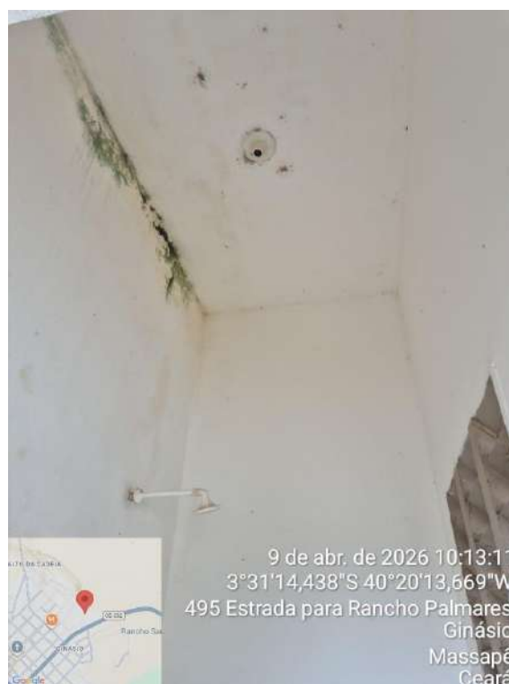
Foto 84 - EEE-01: Banheiro sem iluminação e pintura desgastada.
