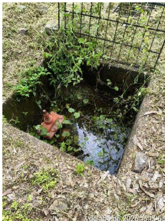
Foto 58 - Pátio (Massapê): caixa de proteção e inspeção com mato crescendo e acúmulo de água em seu interior.
