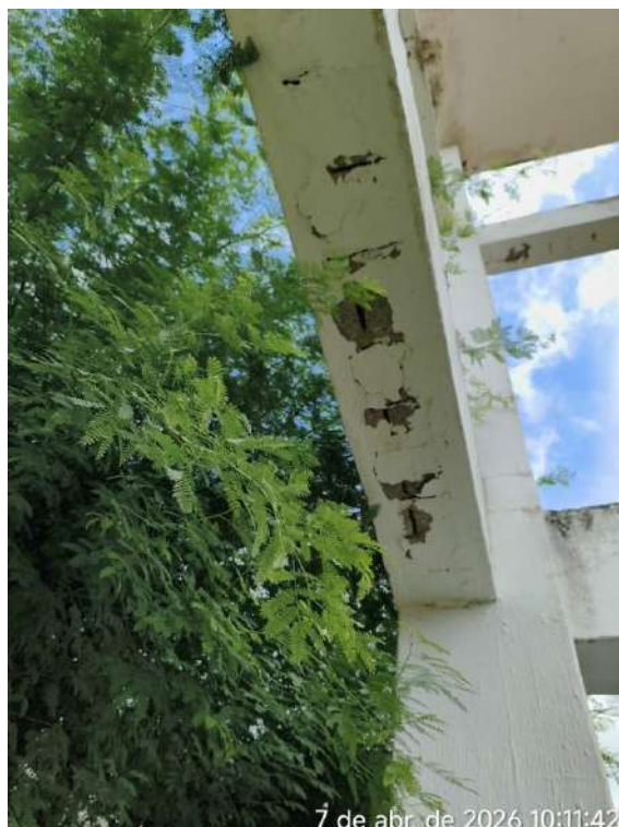
Foto 68 - REL-03 (Mumbaba): anomalias na infraestrutura, como ferragens expostas nas vigas e pintura desgastada.
