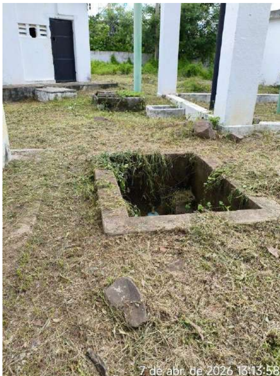
Foto 19 - Pátio (Massapê): caixas de proteção sem tampa.
