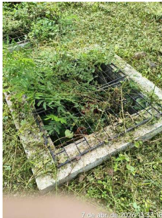
Foto 60 - Pátio (Massapê): caixa de proteção e inspeção com mato crescido em seu interior.
