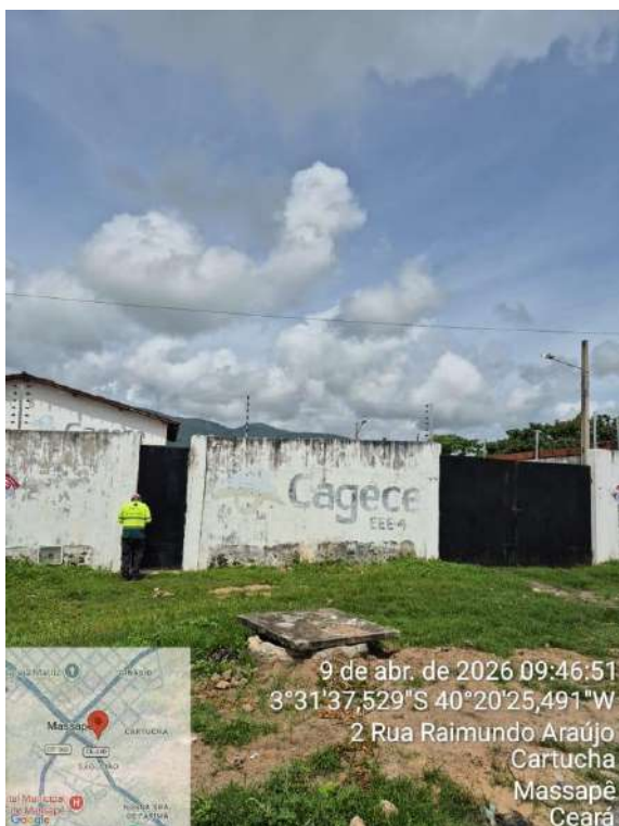
Foto 99 - EEE-04: pintura e identificação desgastadas.
