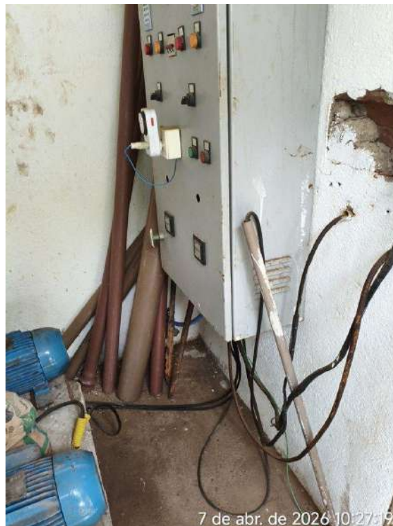
Foto 75 - EEAT-05 (Mumbaba): pintura e paredes deterioradas, com buracos e área ocupada por material armazenado.
