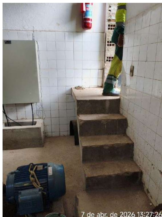
Foto 26 - EEAT-03 (Massapê): escada sem guarda-corpo ou grade de proteção.
