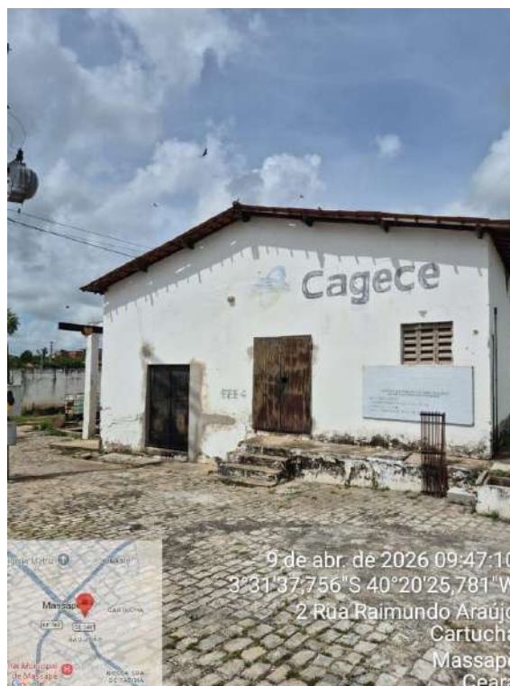
Foto 100 - EEE-04: pintura e identificação desgastadas; portões internos de acesso oxidados.
