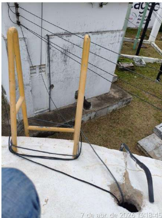
Foto 23 - RAP-02 (Massapê): fiação presa à escada, implantada sem eletroduto de proteção e isolamento; furo inacabado, vulnerável ao acesso de contaminantes.
