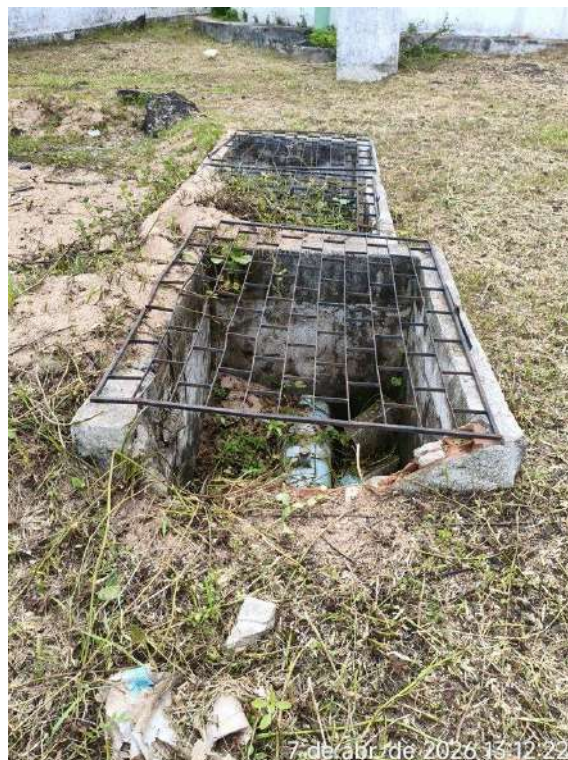
Foto 54 - Pátio (Massapê): caixa de proteção e inspeção deterioradas e com mato crescido e entulhos em seu interior.
