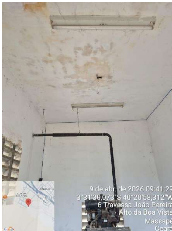
Foto 98 - EEE-03: sala do gerador: teto com sinais de infiltração; ausência de iluminação.
