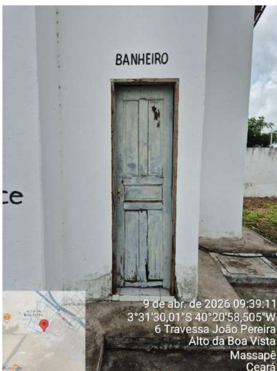
Foto 95 - EEE-03: banheiro: péssimo estado de conservação, porta danificada.
