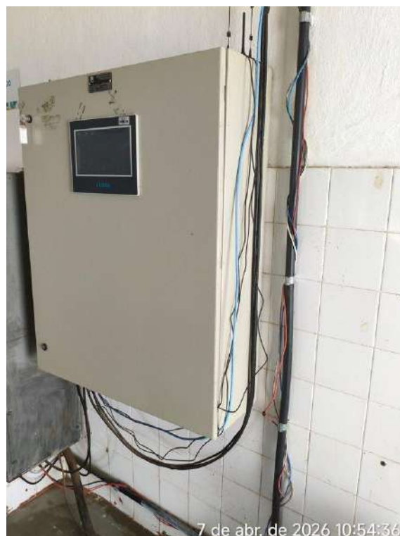
Foto 10 - ETA / Estações Elevatórias (Ipaguaçu): instalações elétricas das EEAT-01 e EEAT-02 sem eletrodutos de proteção e isolamento.
