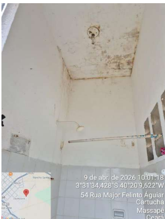
Foto 87 - EEE-02: Banheiro em péssimo estado de conservação: sem iluminação; vaso sanitário sem tampa; sinais de infiltração no teto
