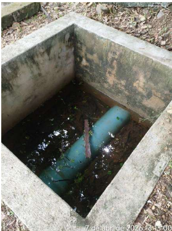
Foto 17 - Pátio (Massapê): caixas de inspeção e proteção sem tampa.
