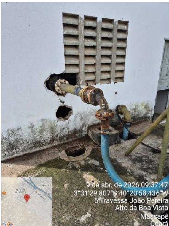
Foto 93 - EEE-03: paredes e pintura deterioradas e buracos sem acabamentos.
