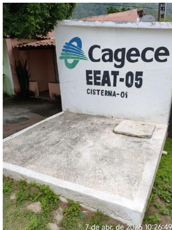
Foto 34 - Cisterna (Mumbaba): tampa sem fechamento hermético, vulnerável à contaminação.
