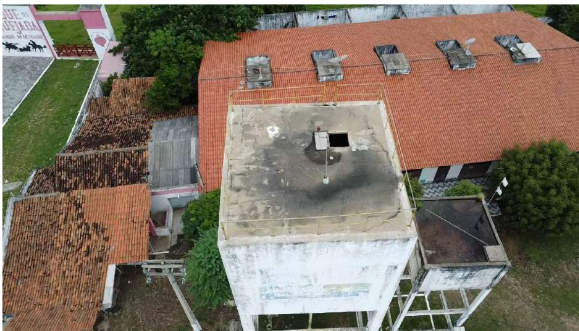
Foto 65 - REL-03 (Mumbaba): tampa de inspeção fora do lugar; apresenta algumas anomalias na infraestrutura, como ferragens expostas nas vigas, pintura desgastada e laje com afundamento e rachaduras.
