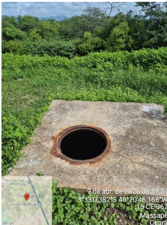
Foto 39 - ETE Massapê: caixas de passagem sem tampa.
