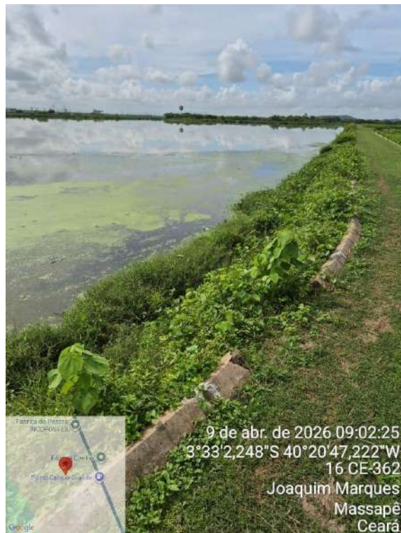
Foto 78 - ETE Massapê: Lagoa facultativa/maturação com excesso de vegetação no entorno; meios-fios danificados.
