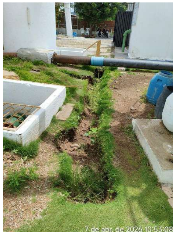
Foto 6 - ETA / Pátio (Ipaguaçu): caixas de saída de água na área do pátio com tampa incompleta e vala escavada aberta no solo.
