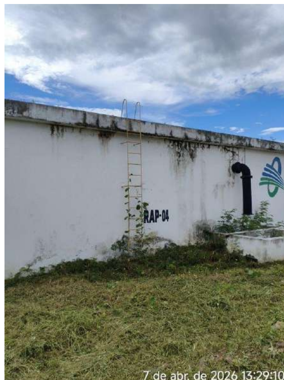
Foto 30 - RAP-04 (Massapê): escada tipo marinho sem gaiola de proteção.
