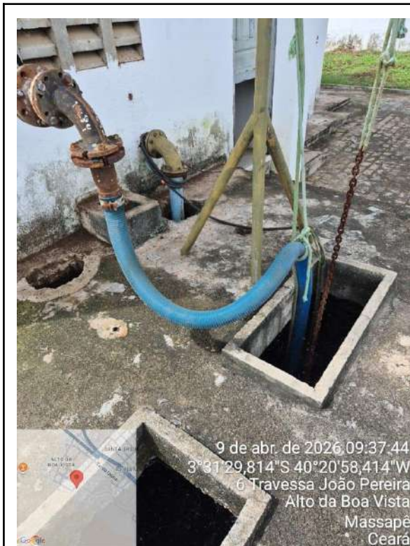
Foto 43 - EEE-03: ausência de tampa/grade de proteção nas aberturas do poço de sucção.
