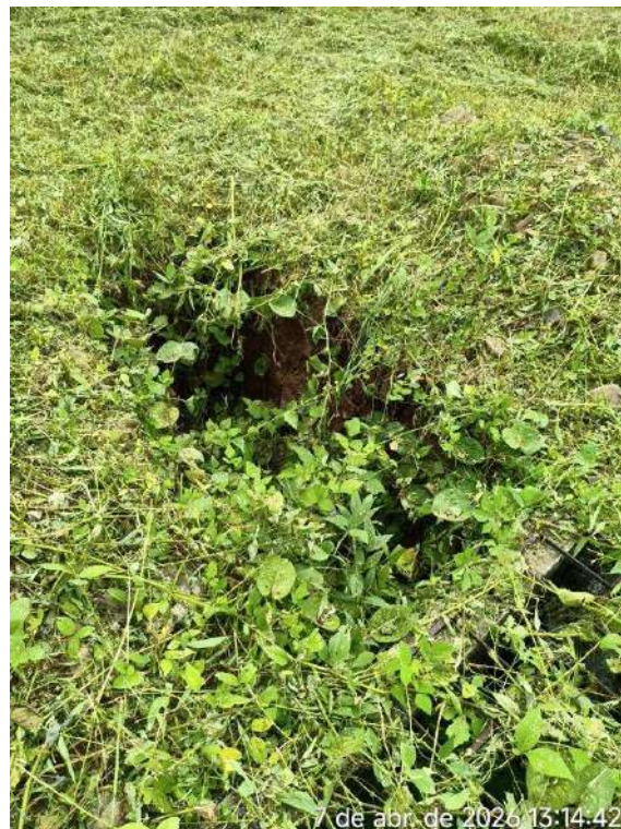
Foto 20 - Pátio (Massapê): caixas de proteção sem tampa.
