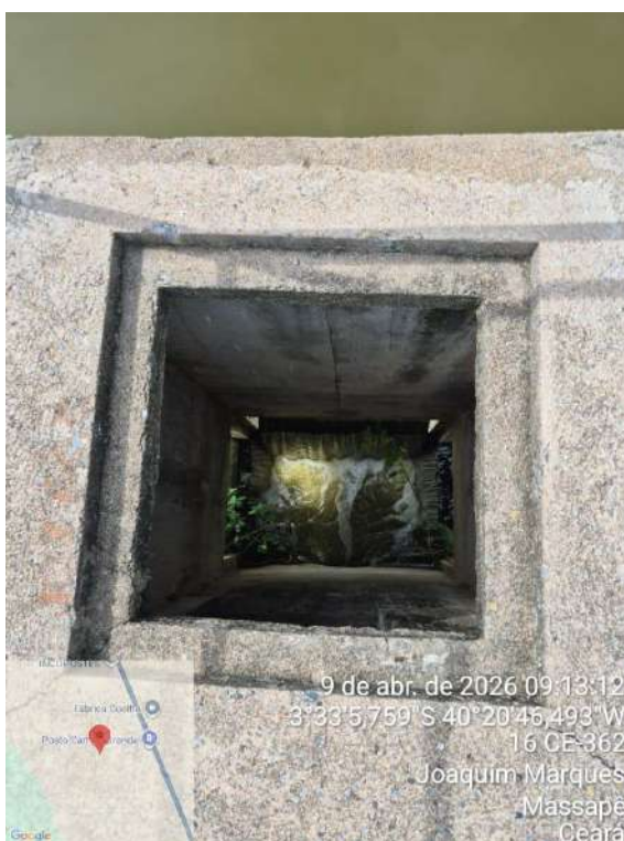
Foto 37 - ETE Massapê: caixas de passagem sem tampa.
