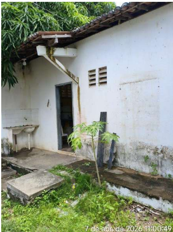
Foto 47 - Casa do operador (Ipaguaçu): infraestrutura inadequada para apoio ao operador.
