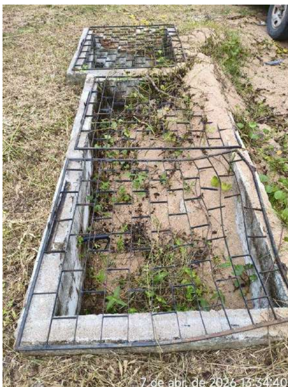
Foto 61 - Pátio (Massapê): caixa de proteção e inspeção com acúmulo de areia.
