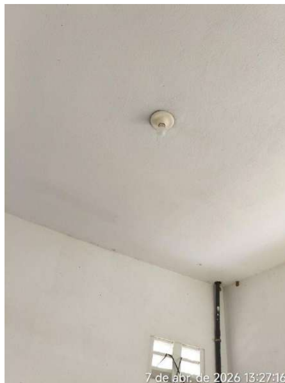
Foto 64 - EEAT-03 (Massapê): iluminação interna está com lâmpada queimada.
