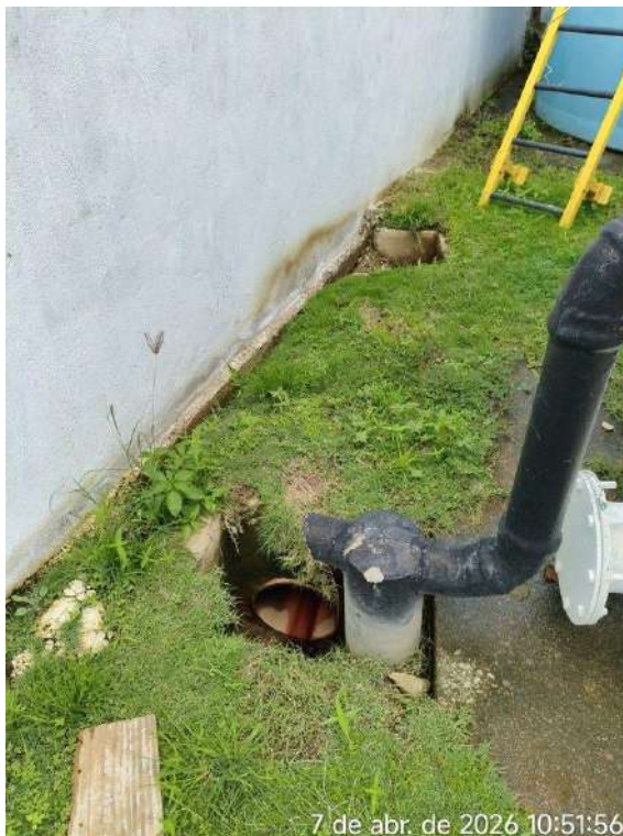
Foto 7 - ETA / Pátio (Ipaguaçu): caixas de saída de água na área do pátio sem tampa.
