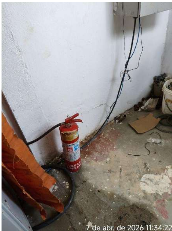
Foto 3 - Casa do quadro de comando (Ipaguaçu): fiação elétrica sem eletrodutos de isolamento e proteção..
