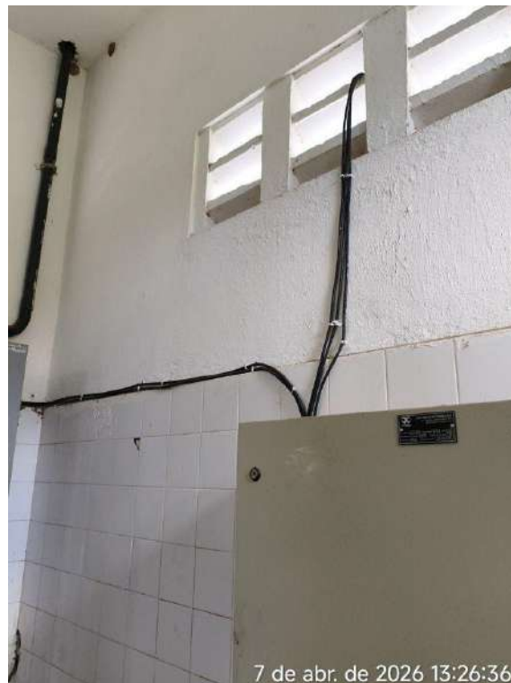
Foto 28 - EEAT-03 (Massapê): instalações elétricas precárias, sem eletroduto de isolamento e proteção, instalada através de cobogós.
