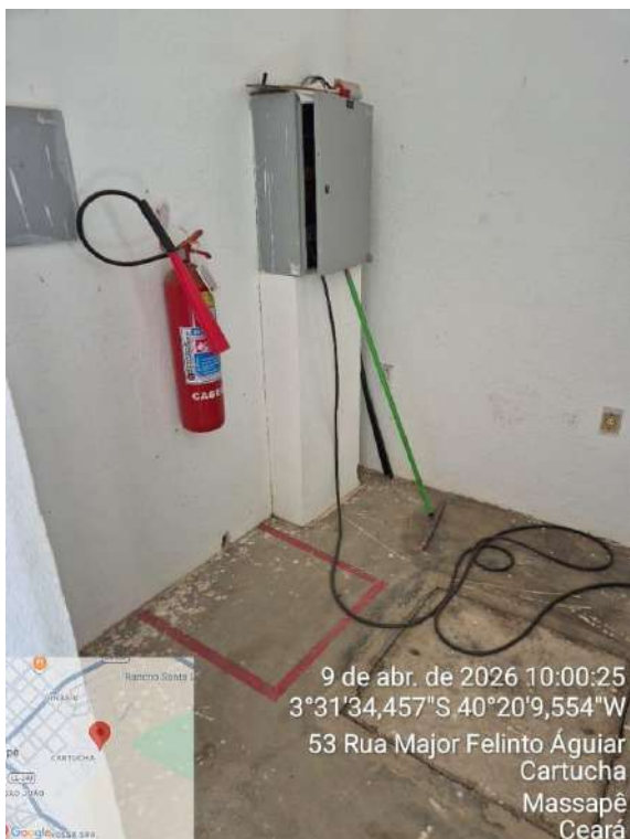
Foto 91 - EEE-02: Casa de bombas com fiação inadequada.
