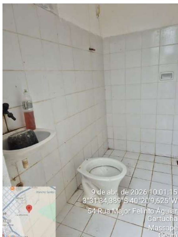
Foto 88 - EEE-02: Banheiro em péssimo estado de conservação: vaso sanitário sem tampa; pia sem encanção.
