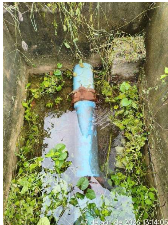
Foto 18 - Pátio (Massapê): caixas de inspeção e proteção sem tampa.
