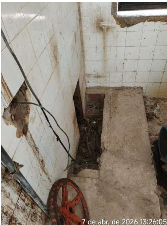
Foto 27 - EEAT-03 (Massapê): instalações elétricas precárias, com calha sem grelha e sem tampa e com fiação sem eletroduto de isolamento.
