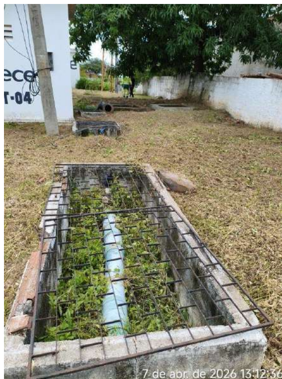
Foto 56 - Pátio (Massapê): caixa de proteção e inspeção deterioradas e com mato crescendo em seu interior.
