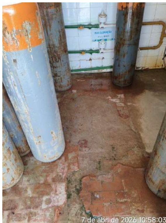
Foto 52 - Casa de Química / Cloração (Ipaguaçu): piso deteriorado.
