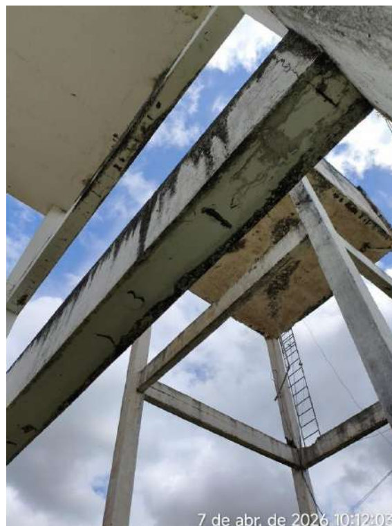
Foto 67 - REL-03 (Mumbaba): anomalias na infraestrutura, como ferragens expostas nas vigas e pintura desgastada.
