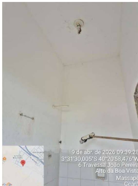
Foto 94 - EEE-03: banheiro péssimo estado de conservação, sem iluminação e com sujeira.
