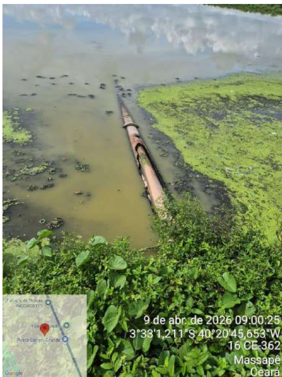
Foto 81 - ETE Massapê: Lagoa facultativa / maturação com excesso de vegetação no entorno, presença de zonas mortas / assoreamento.
