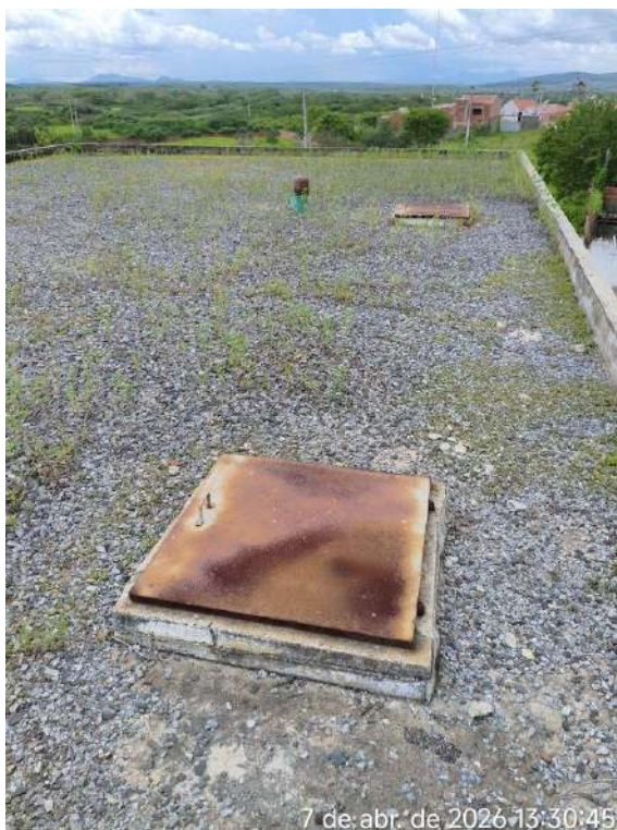
Foto 63 - RAP-04 (Massapê): tampa de inspeção em processo de corrosão.
