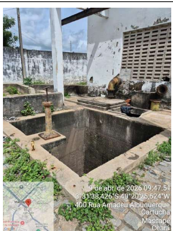
Foto 44 - EEE-04: ausência de tampa/grade de proteção na abertura do poço de sucção.
