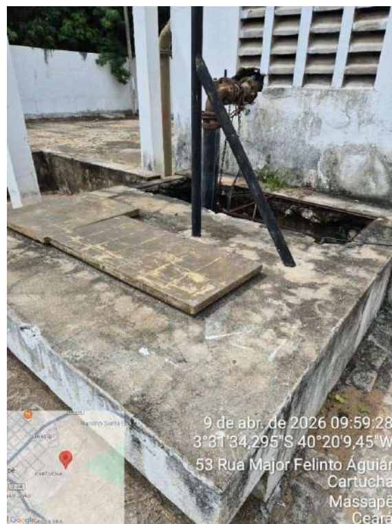
Foto 42 - EEE-02: ausência de tampa/grade de proteção na abertura do poço de sucção.
