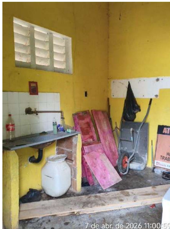
Foto 48 - Casa do operador (Ipaguaçu): infraestrutura servindo de depósito de materiais e equipamentos, sem organização e controle.
