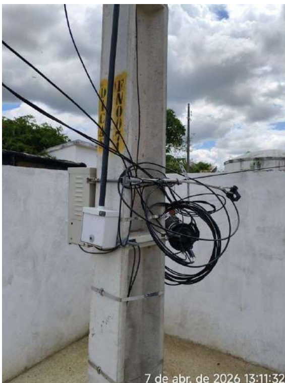
Foto 13 - Pátio (Massapê): instalações danificadas, emaranhadas junto à base do poste, cabeamento de alimentação instalado em altura baixa.
