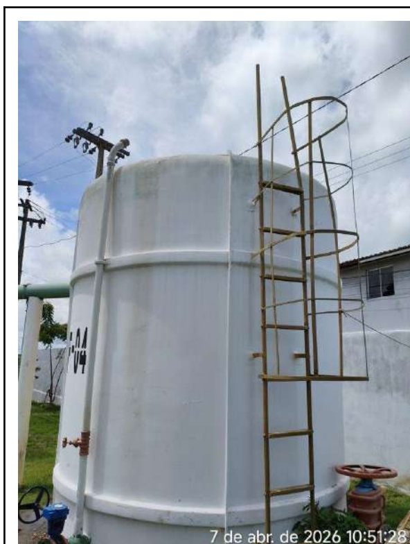
Foto 45 - F-04 (Ipaguaçu): a escada está danificada.
