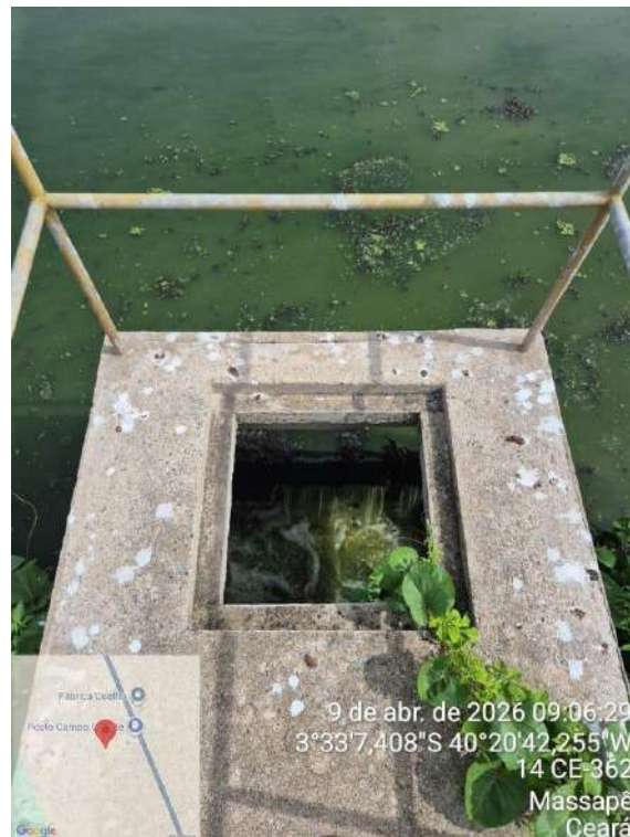
Foto 40 - ETE Massapê: caixas de passagem sem tampa.
