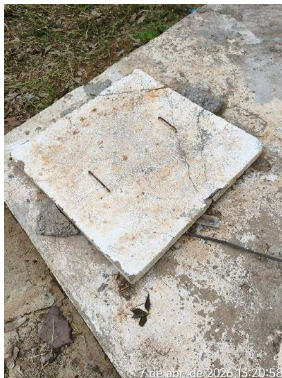
Foto 24 - REN (Massapê): tampa sem fechamento hermético, vulnerável ao acesso de contaminantes; fiação implantada através da abertura de inspeção.
