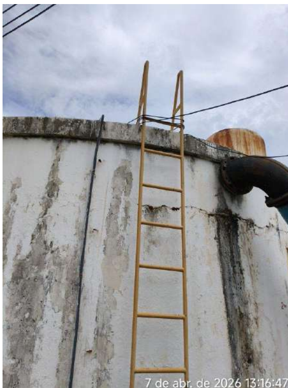
Foto 21 - RAP-02 (Massapê): escada inadequada, sem gaiola e grade de proteção acima do patamar superior.
