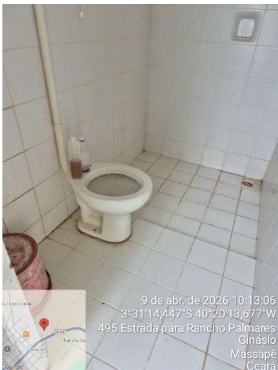
Foto 85 - EEE-01: banheiro sem iluminação e vaso sanitário sem assento com tampa.
