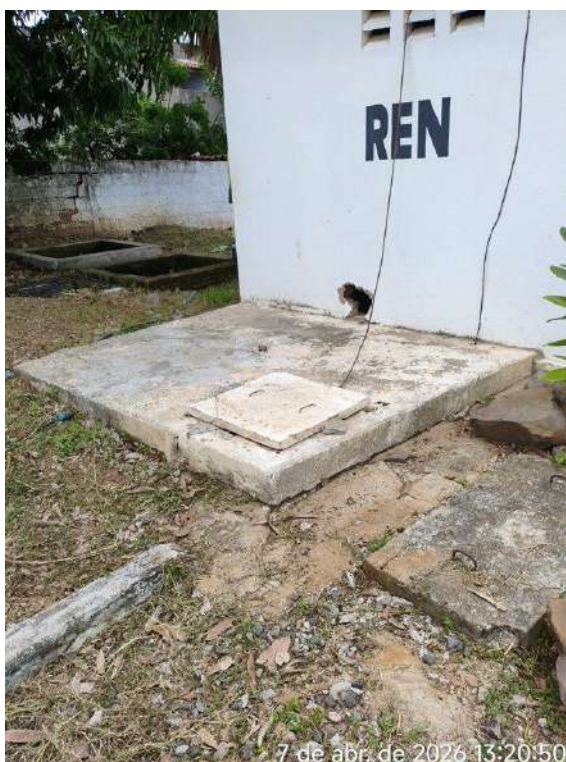
Foto 25 - REN (Massapê): tampa sem fechamento hermético; fiação conduzida através da entrada de inspeção e de cobogós, sem eletrodutos de isolamento e proteção.
