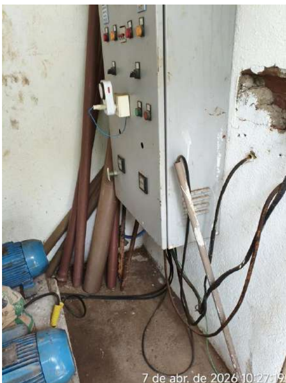
Foto 33 - EEAT-05 (Mumbaba): instalações elétricas sem eletroduto e isolamento de proteção.
