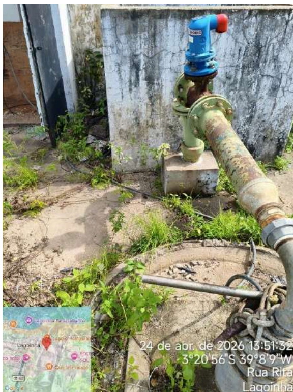
Foto 23 - PT-03 (Lagoinha): fiação sem eletrodutos na área do pátio.
