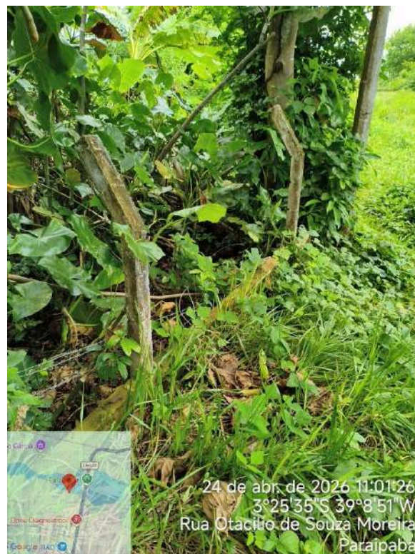
Foto 40 - Captação (sede): cerca de proteção danificada e com vegetação alta.
