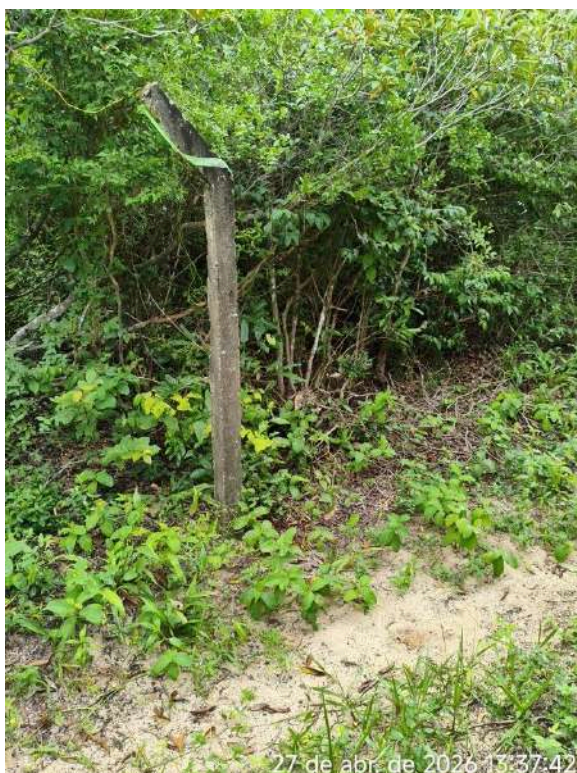
Foto 107 - ETE Lagoinha : cerca de proteção possui aberturas e partes danificadas.
