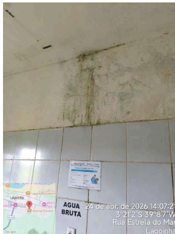
Foto 87- ETA Lagoinha: Laboratório e Casa de Química com pintura desgastada.
