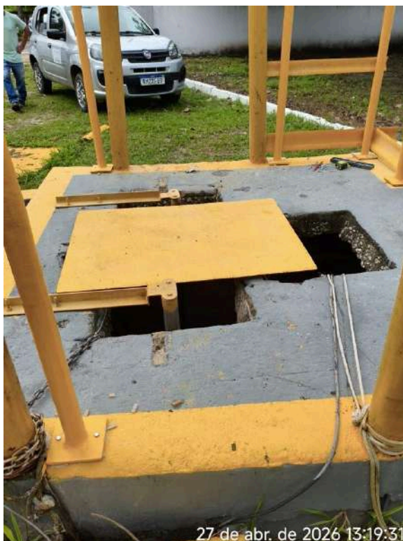
Foto 101 - EEE-03 (Lagoinha): tampa sem vedação adequada.
