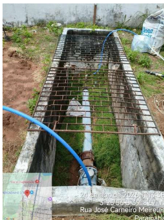
Foto 50 - ETA Paraipaba: grade incompleta.
