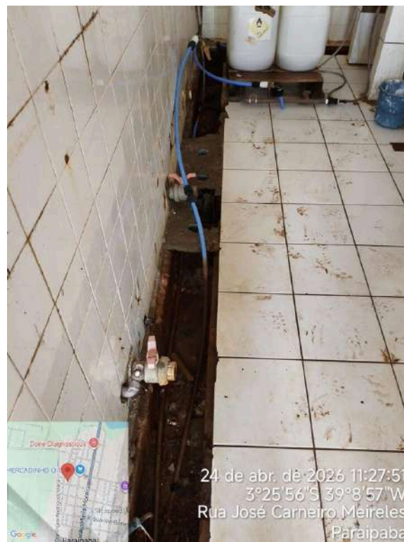
Foto 8 - ETA Paraipaba: casa de química com calha sem grade de proteção; sujeidade.
