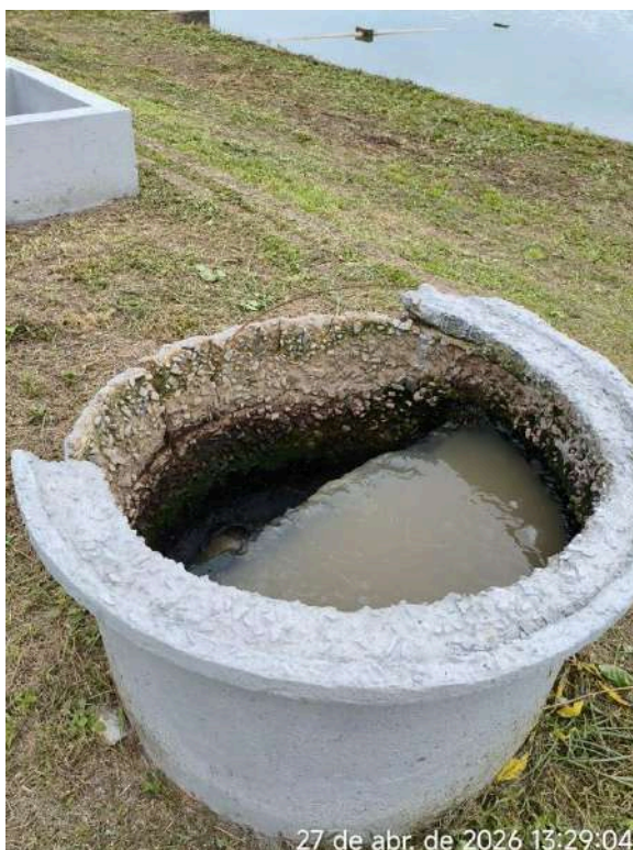
Foto 103 - ETE Lagoinha: caixa de chegada do tratamento preliminar danificada.
