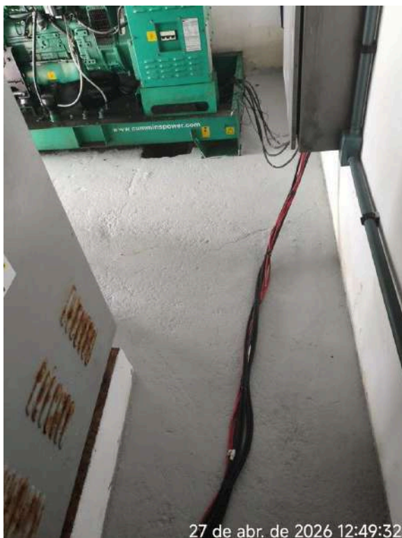
Foto 35 - EEE-02 (Lagoinha): fiação exposta sobre o piso e sem eletroduto.
