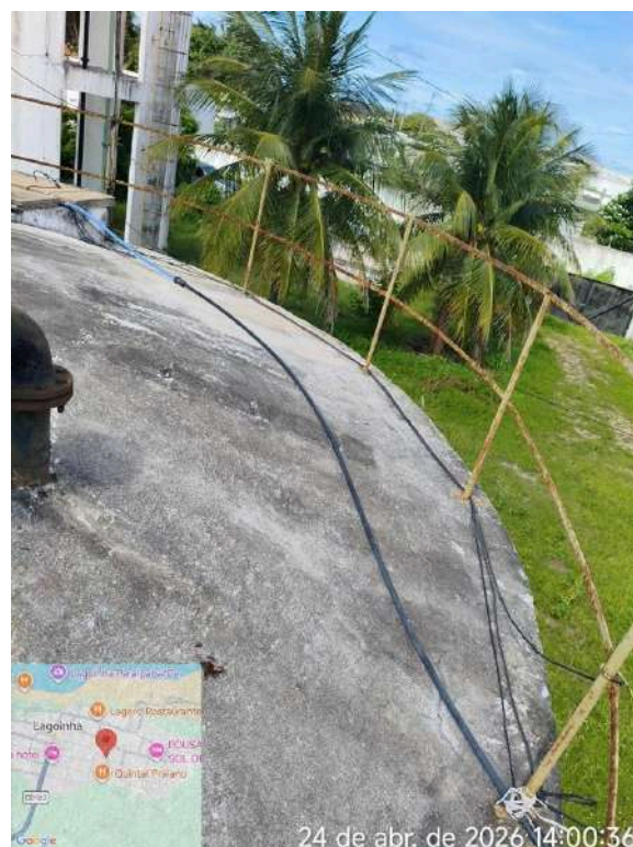
Foto 26 - ETA Lagoinha: RAP-01 com fiação inadequada.
