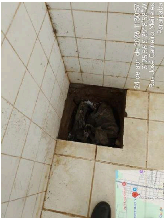
Foto 13 - ETA Paraipaba: casa de bombas com abertura no piso sem proteção.
