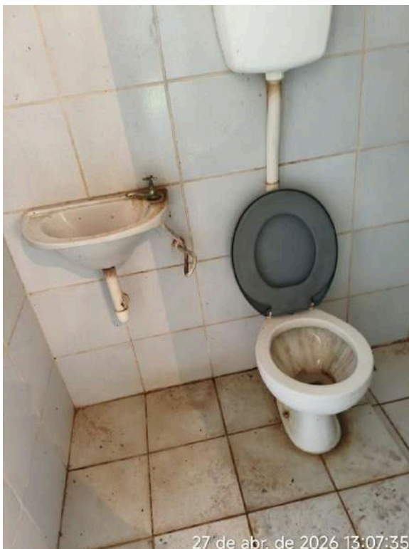
Foto 99 - EEE-01 ( Lagoinha ): banheiro sem iluminação e com sujidades.
