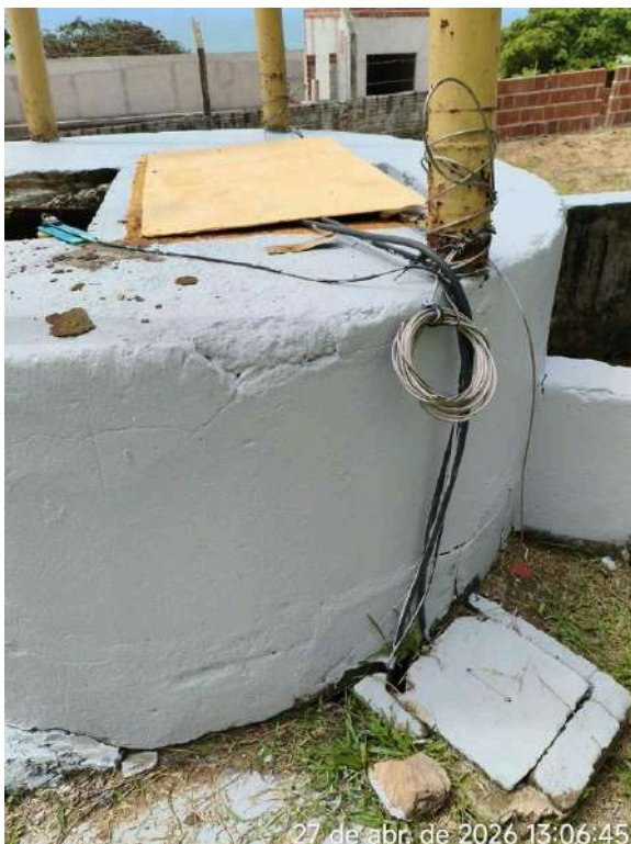
Foto 33 - EEE-01 (Lagoinha): fiação sem eletroduto.
