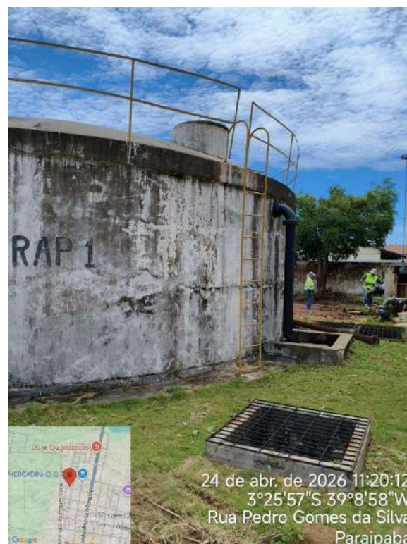
Foto 6 - ETA Paraipaba: RAP-1 com escada sem gaiola de proteção.
