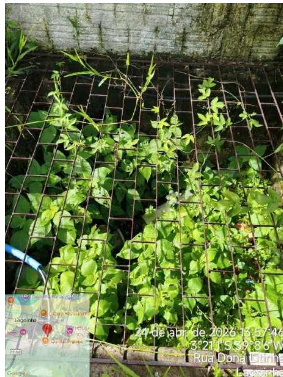
Foto 80 - ETA Lagoinha: vegetação crescida nas caixas de proteção e inspeção.
