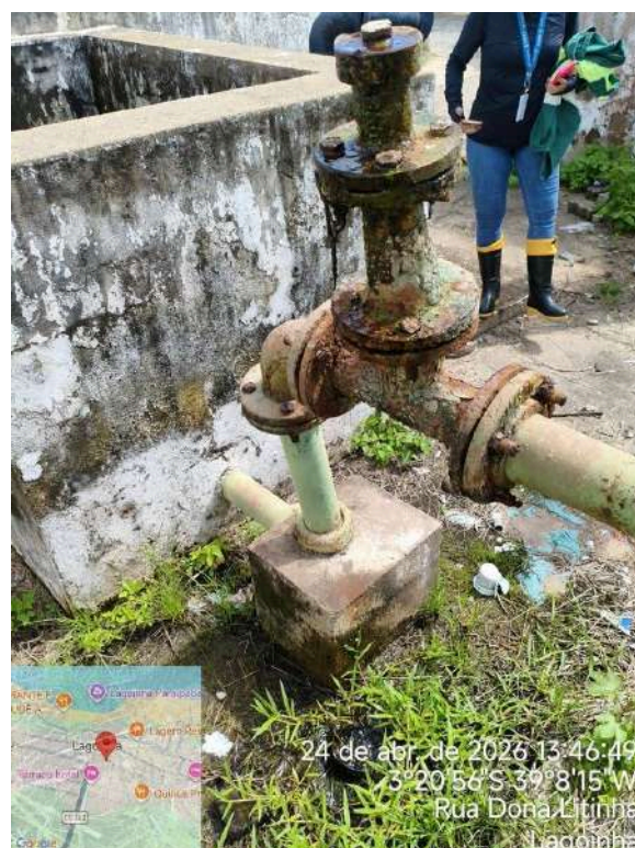
Foto 70 - PT-02 (Lagoinha): vazamento no registro com corrosão avançada.
