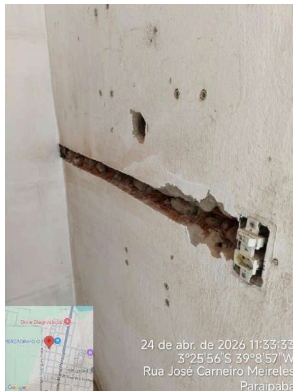
Foto 16 - ETA Paraipaba: casa de cloro com caixa de energia sem tampa.
