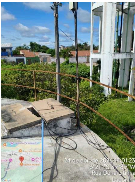
Foto 27 - ETA Lagoinha: RAP-01 com fiação inadequada.
