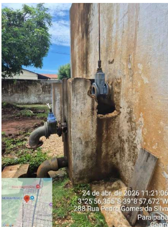
Foto 53 - ETA Paraipaba: caixa danificada.
