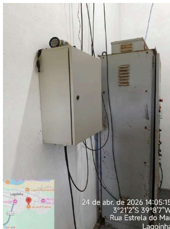
Foto 30 - ETA Lagoinha: EEAT-01 com fiação sem eletrodutos.
