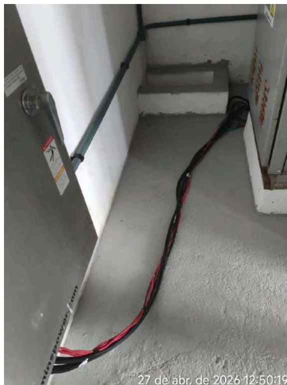
Foto 36 - EEE-02 (Lagoinha): fiação exposta sobre o piso e sem eletroduto.
