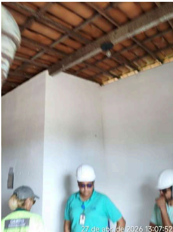
Foto 97 - EEE-01 ( Lagoinha ): casa do grupo gerador sem iluminação funcional.
