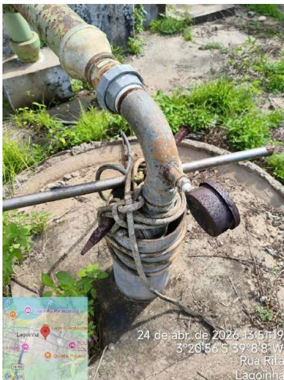
Foto 75 - PT-03 (Lagoinha): poço sem vedação da tubulação de revestimento.
