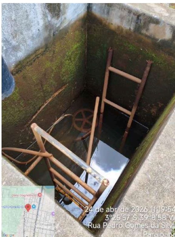
Foto 57 - ETA Paraipaba: caixas de descarga dos RAPs apresentam acúmulo de água.
