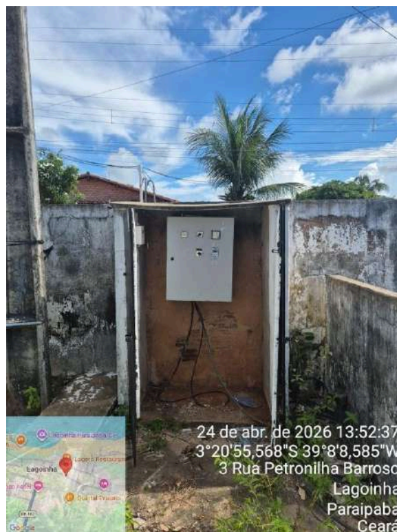
Foto 74 - PT-03 (Lagoinha): casa do quadro de comando com reboco e pintura deteriorados.
