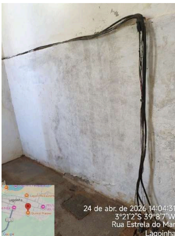
Foto 29 - ETA Lagoinha: EEAT-01 com fiação sem eletrodutos.
