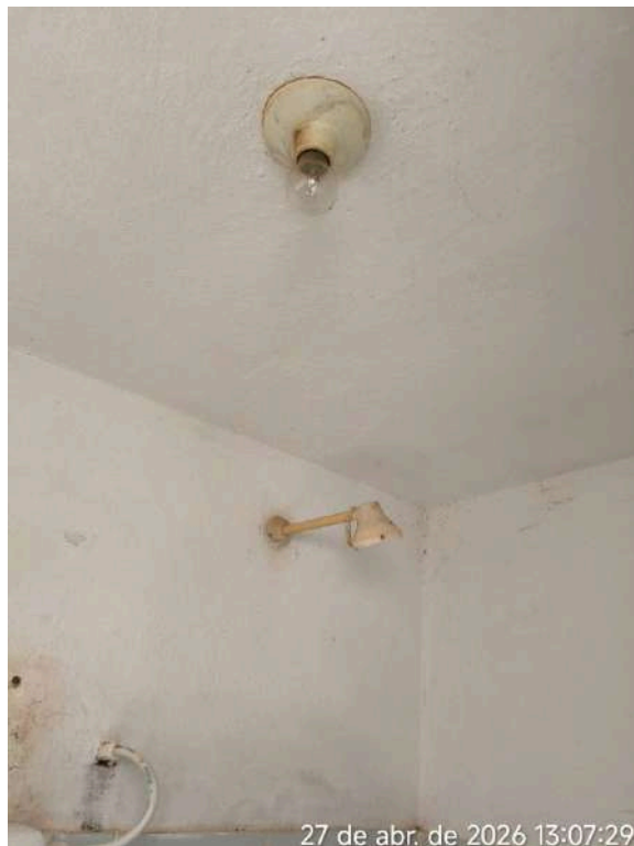
Foto 98 - EEE-01 ( Lagoinha ): banheiro com pintura deteriorada e sem iluminação funcional.
