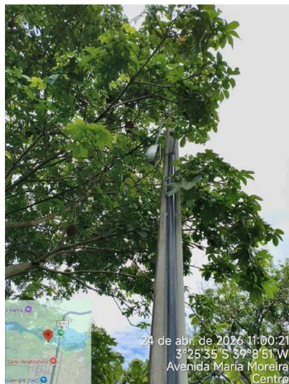
Foto 42 - Captação (sede): área sem iluminação externa funcional.
