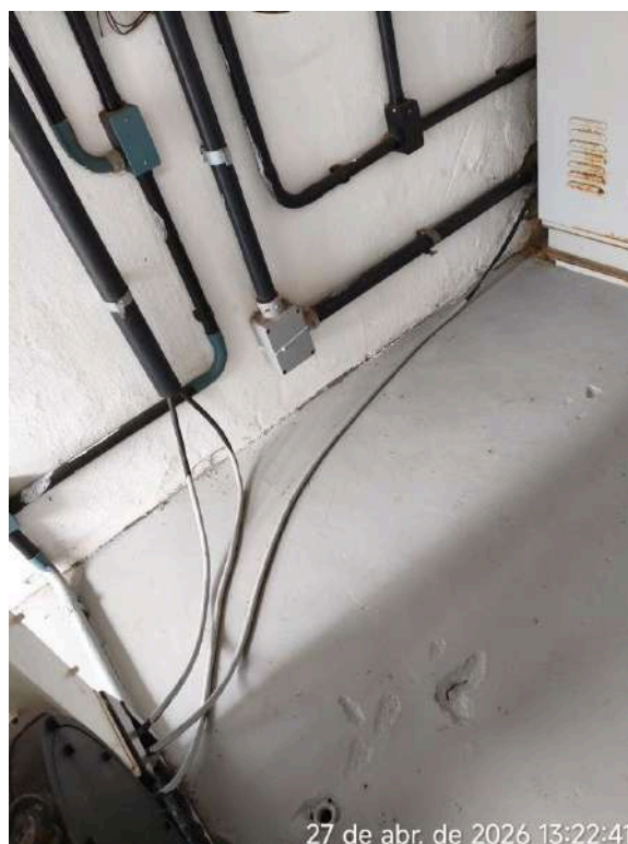
Foto 38 - EEE-03 (Lagoinha): fiação exposta sobre o piso e sem eletroduto.
