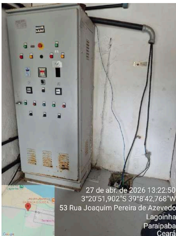
Foto 37 - EEE-03 (Lagoinha): caixa sem tampa e fiação sem eletroduto.
