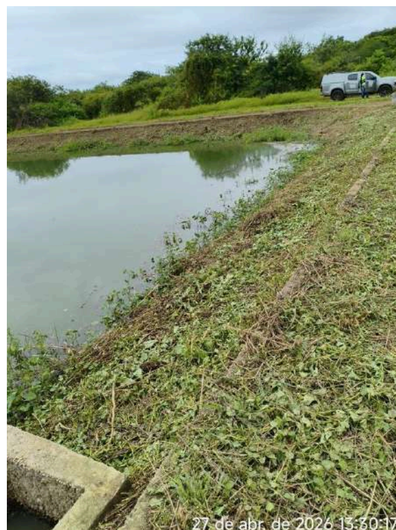
Foto 104 - ETE Lagoinha: taludes com meio-fio e drenagem de água comprometidos.
