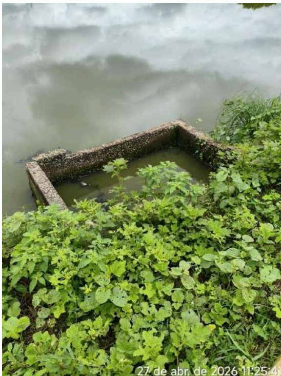
Foto 93- ETE Paraipaba: caixas de saída das lagoas quebradas.
