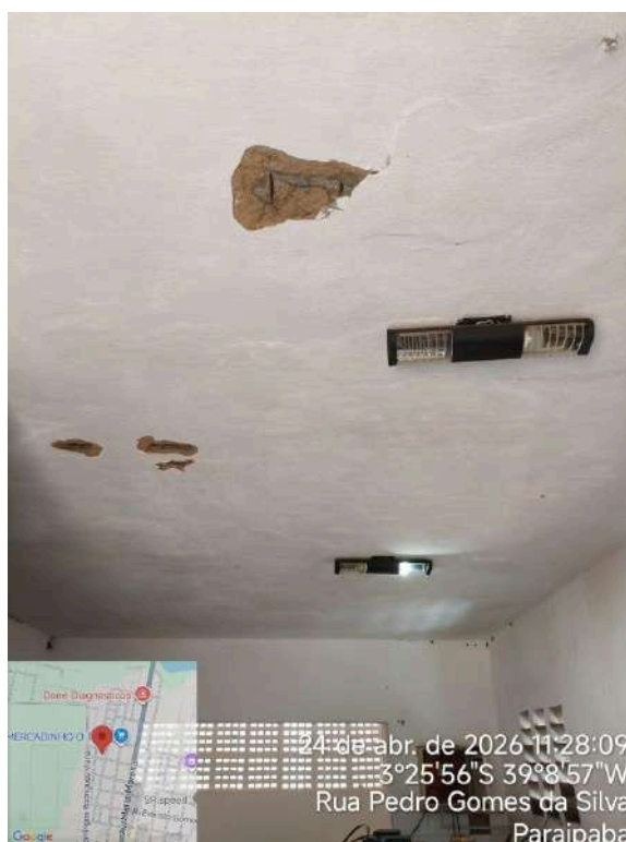
Foto 59 - ETA Paraipaba: casa de química com pintura deteriorada e teto com armadura exposta.
