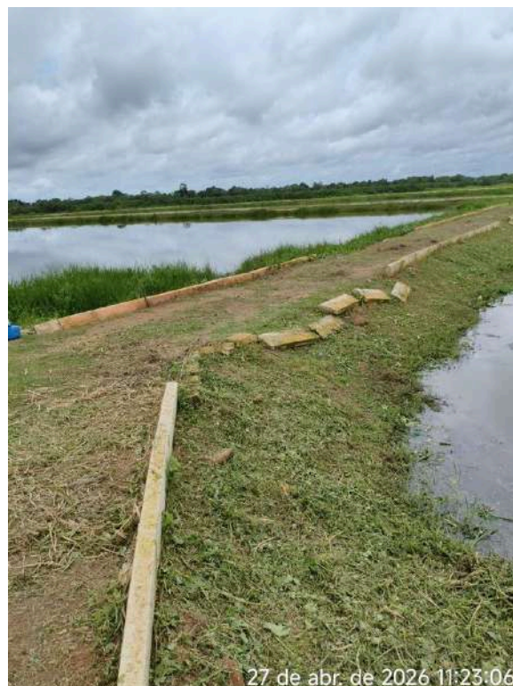
Foto 91- ETE Paraipaba : taludes com meio-fio danificado, sem drenagem lateral.
