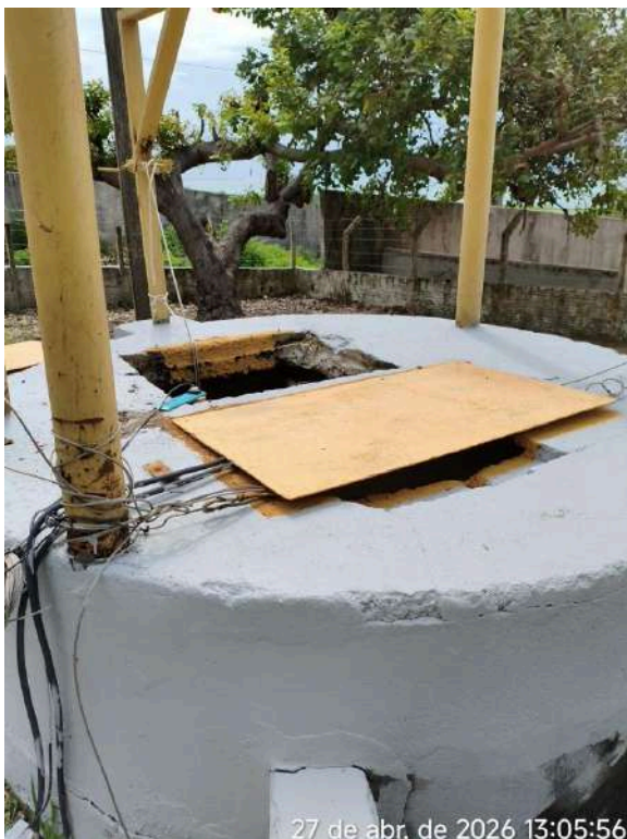
Foto 95- EEE-01 (Lagoinha): tampa do poço de sucção incompleta.
