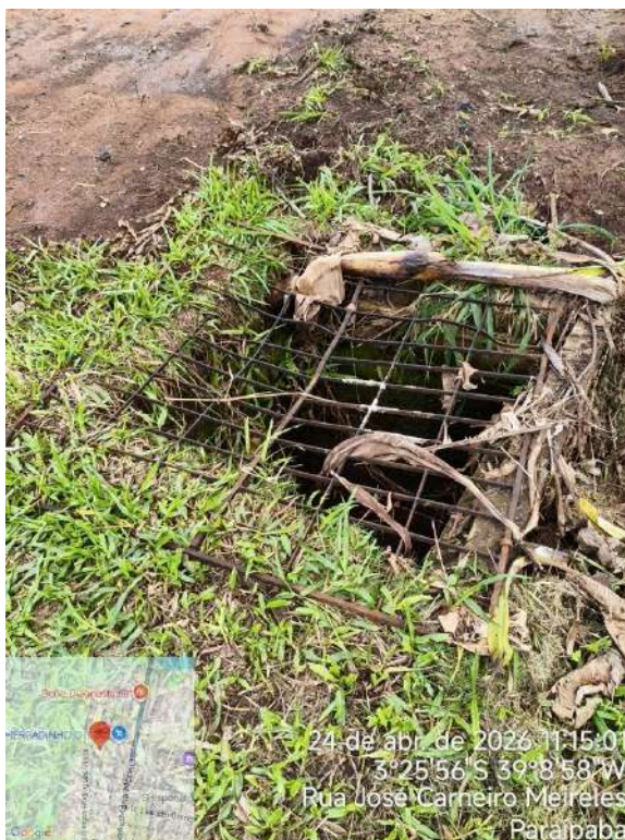
Foto 51 - ETA Paraipaba: grade danificada.
