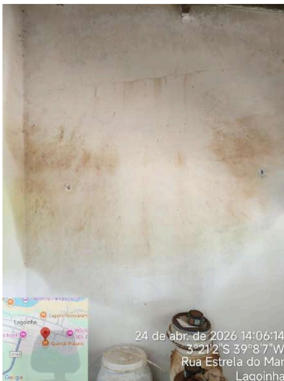
Foto 86- ETA Lagoinha: Laboratório e Casa de Química com pintura desgastada.
