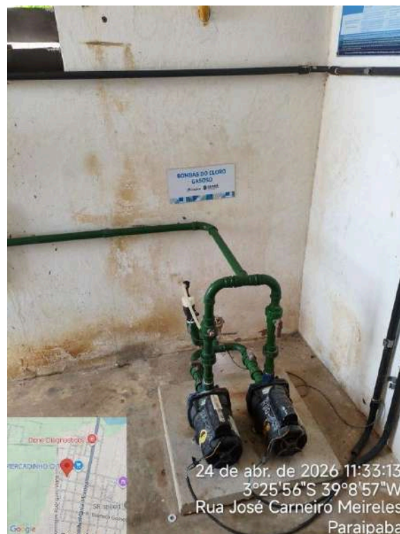
Foto 64 - ETA Paraipaba: casa de cloro com pintura deteriorada e piso com sujeira.
