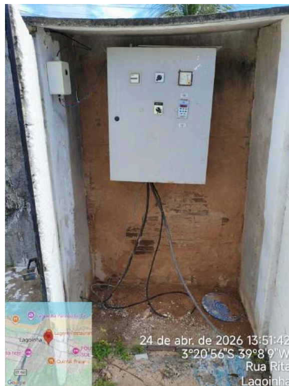
Foto 24 - PT-03 (Lagoinha): fiação sem eletrodutos no painel do comando.
