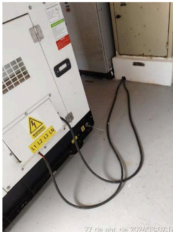
Foto 34 - EEE-01 (Lagoinha): fiação sem eletroduto.
