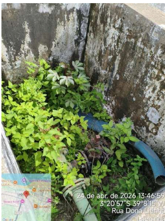
Foto 69 - PT-02 (Lagoinha): caixa com pintura deteriorada e vegetação crescida.
