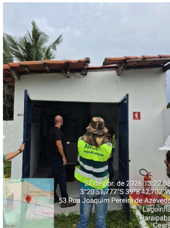
Foto 102 - EEE-03 (Lagoinha): telhado da casa do gerador danificado.
