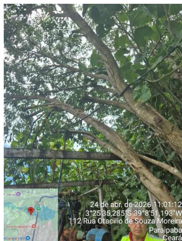
Foto 2 - Captação (sede): fiação sem eletroduto de proteção e isolamento, obstruindo o acesso à plataforma e instalações.
