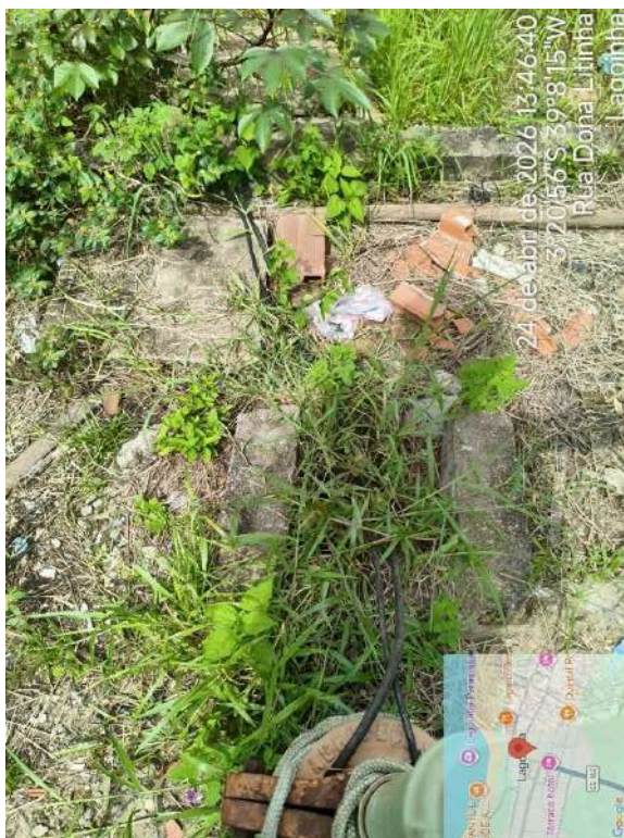
Foto 19 - PT-02 (Lagoinha): fiação solta sem eletrodutos na área de circulação.
