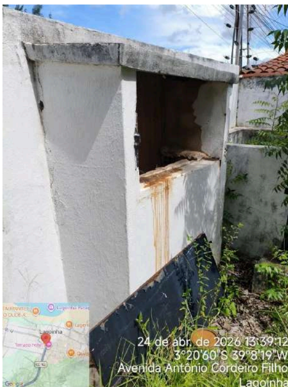
Foto 65 - PT-01 (Lagoinha): tampa de proteção do painel de comando caída.
