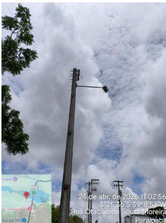
Foto 43 - Captação (sede): pátio sem iluminação externa funcional.
