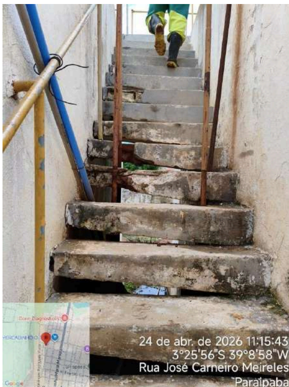
Foto 55 - ETA Paraipaba: escada de acesso ao decantador está deteriorada.
