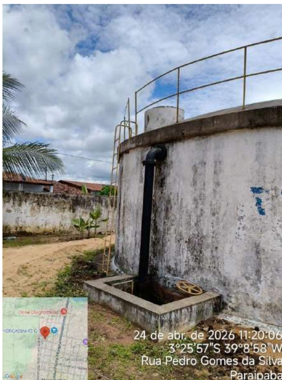
Foto 7 - ETA Paraipaba: RAP-2 com escada sem gaiola de proteção.
