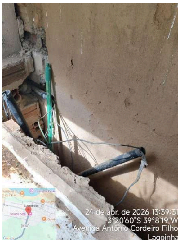
Foto 17 - PT-01 (Lagoinha): casa do quadro de comando com fiação exposta e acessível.
