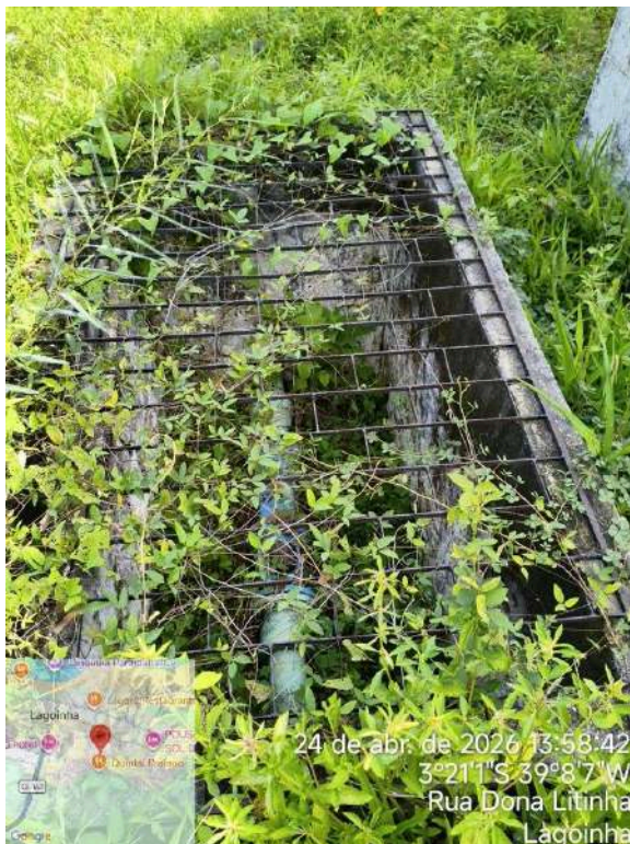
Foto 79 - ETA Lagoinha: vegetação crescida nas caixas de proteção e inspeção.
