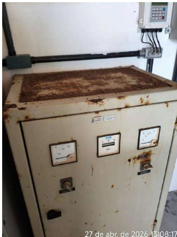
Foto 96- EEE-01 (Lagoinha): grupo gerador com quadro de comando em processo corrosivo.
