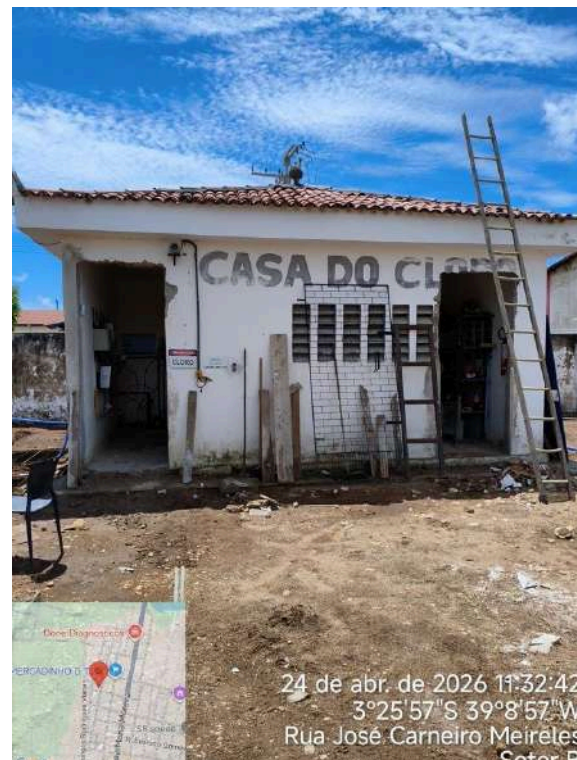
Foto 14 - ETA Paraipaba: casa de cloro sem portas.
