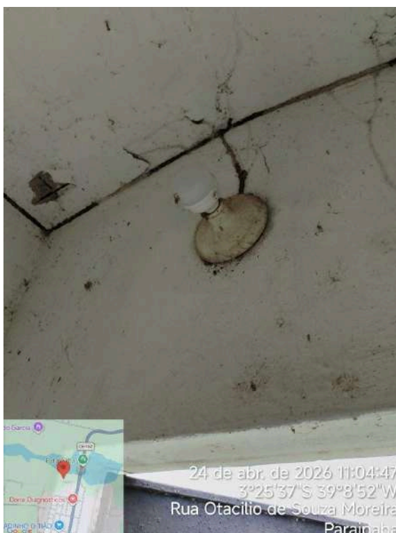
Foto 45 - Captação (sede): casa de comando sem iluminação interna e pintura deteriorada.
