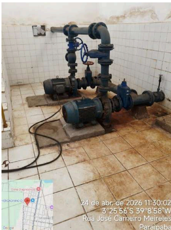
Foto 63 - ETA Paraipaba: casa de bombas com pintura deteriorada e piso com sujeira.
