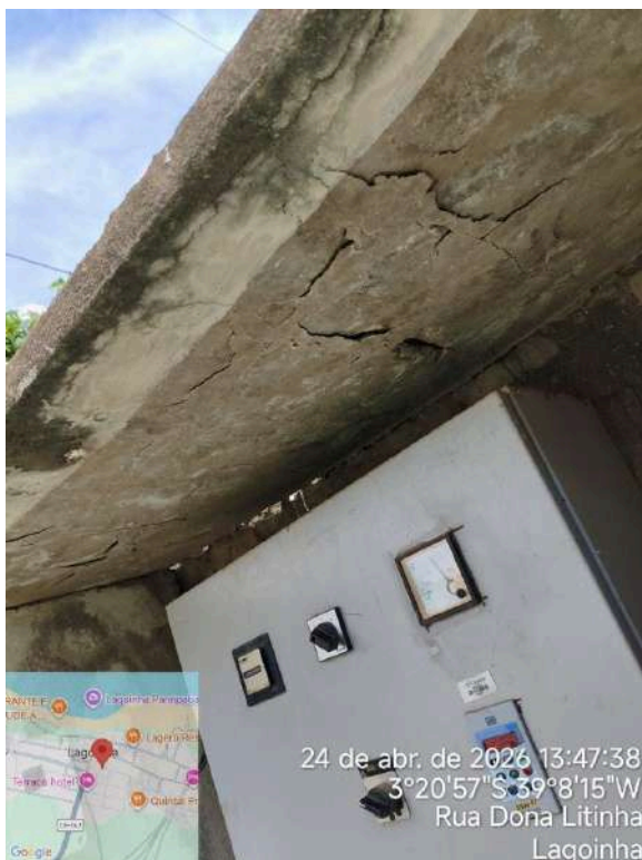
Foto 71 - PT-02 (Lagoinha): casa do quadro de comando com pintura e teto deteriorado.
