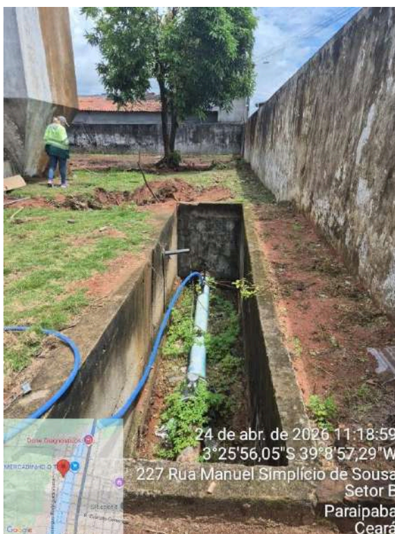
Foto 5 - ETA Paraipaba: caixa sem grade de proteção.
