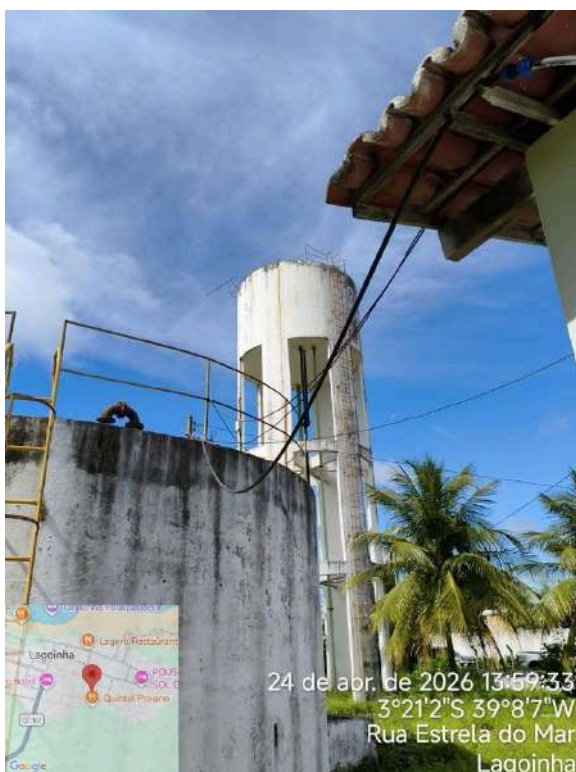
Foto 25 - ETA Lagoinha: RAP-01 com fiação inadequada.
