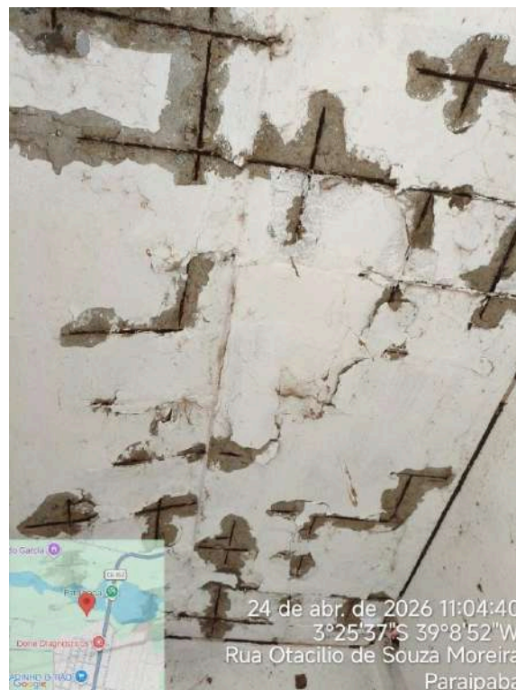
Foto 44 - Captação (sede): casa de comando com teto com armadura exposta e pintura deteriorada.
