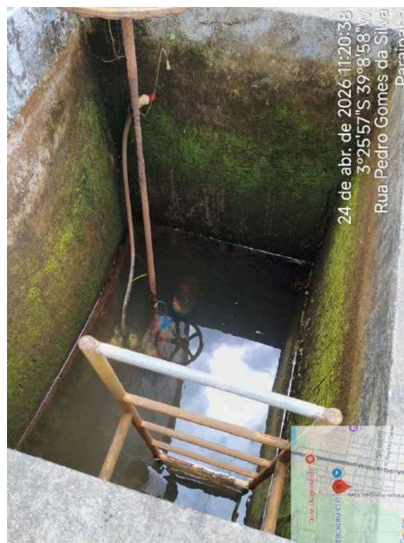
Foto 58 - ETA Paraipaba: caixas de descarga dos RAPs apresentam acúmulo de água.
