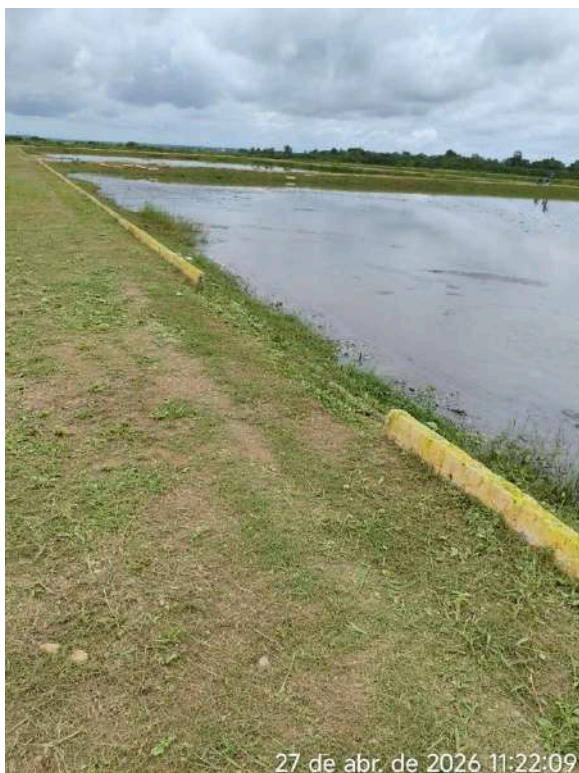
Foto 90- ETE Paraipaba : taludes com meio-fio danificado, sem drenagem lateral.
