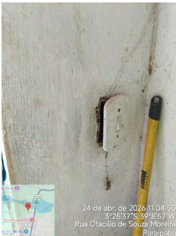
Foto 47 - Captação (sede): casa de comando com interruptor danificado, sem fixação e pintura deteriorada.
