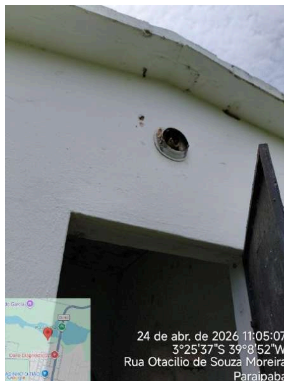
Foto 46 - Captação (sede): casa de comando sem iluminação externa.
