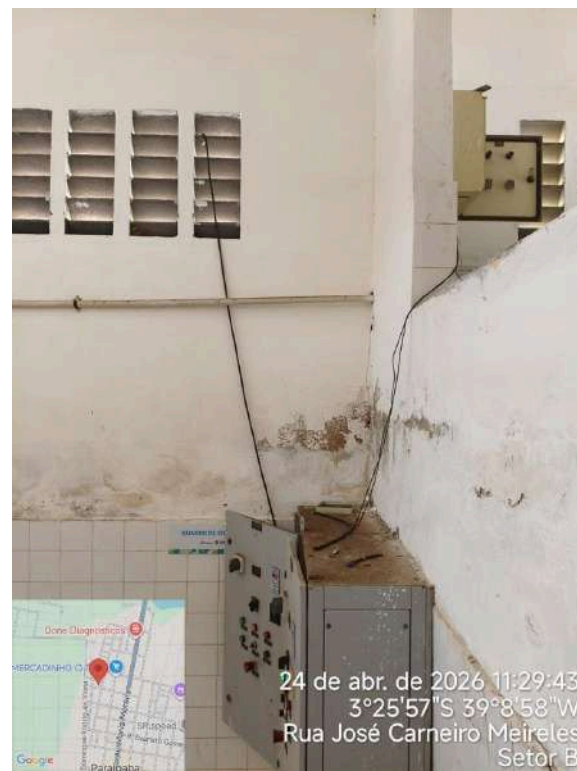
Foto 12 - ETA Paraipaba: casa de bombas com fiação através de cobogó e sem proteção.
