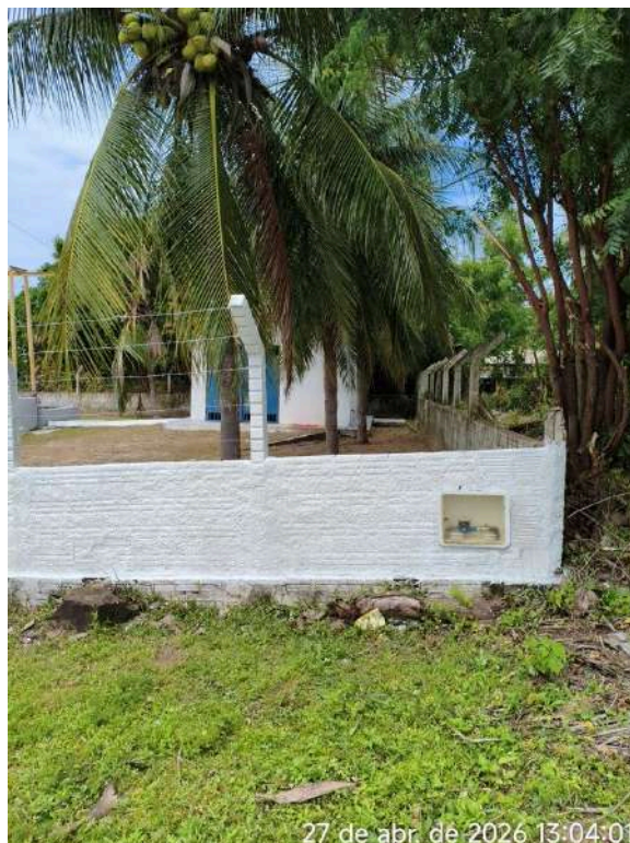
Foto 100 - EEE-01 ( Lagoinha ): cerca de proteção danificada.
