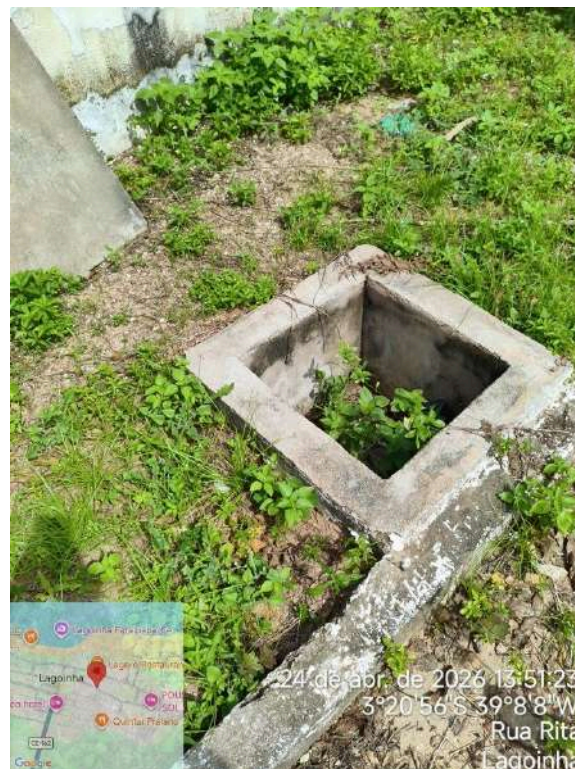
Foto 22 - PT-03 (Lagoinha): caixa sem grade de proteção.
