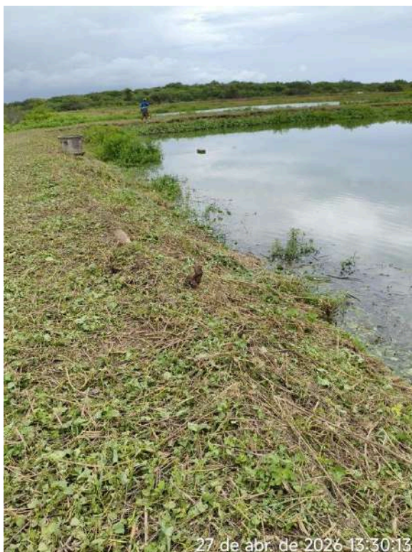
Foto 105 - ETE Lagoinha : taludes com meio-fio e drenagem de água comprometidos.
