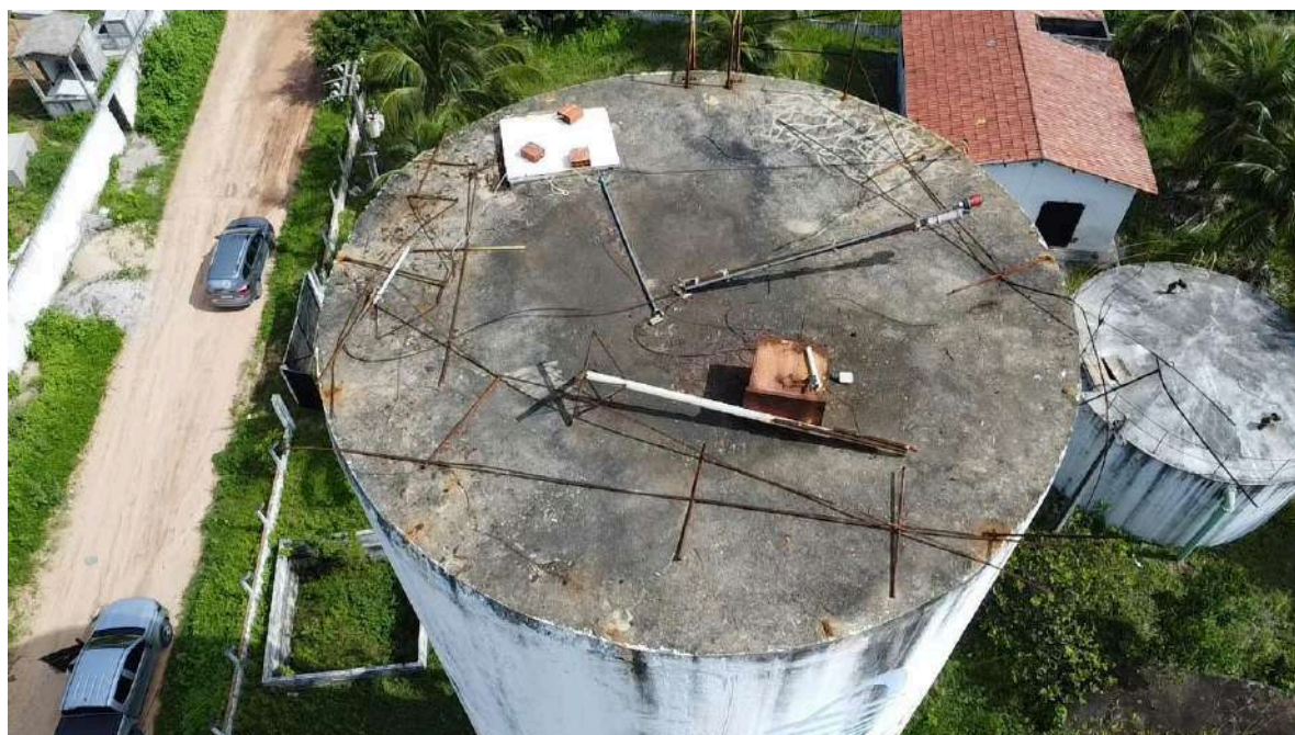
Foto 85- ETA Lagoinha: REL-01 com grade de proteção da laje superior danificada, escada de acesso em processo de corrosão e pára-raios danificados.
