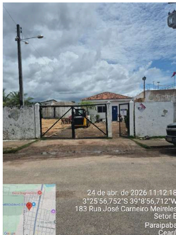
Foto 48 - ETA Paraipaba: muro de entrada com pintura e identificação desgastadas.
