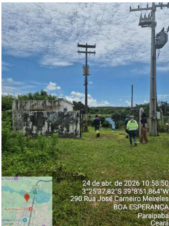
Foto 39 - Captação (sede): área cercada com muro necessitando de pintura e identificação.
