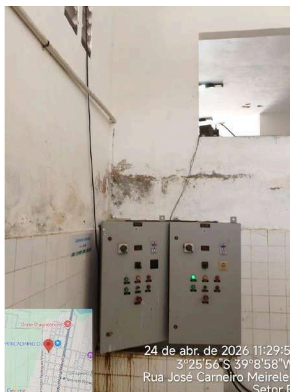
Foto 62 - ETA Paraipaba: casa de bombas com pintura deteriorada e sujeidade.
