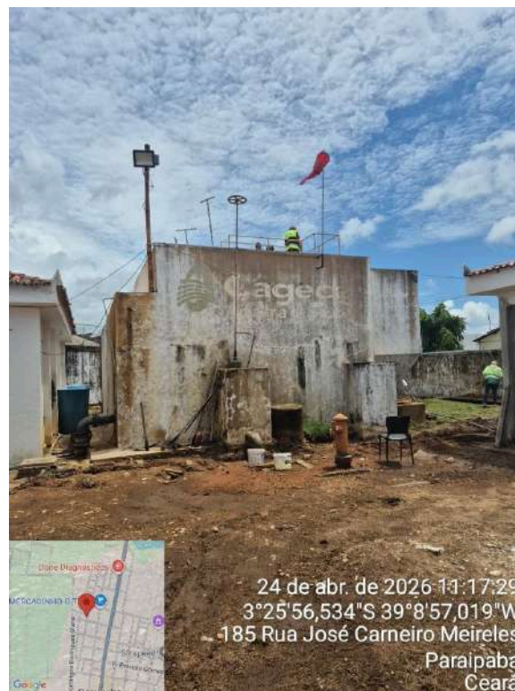
Foto 52 - ETA Paraipaba: Flocculador com pintura e identificação desgastadas.
