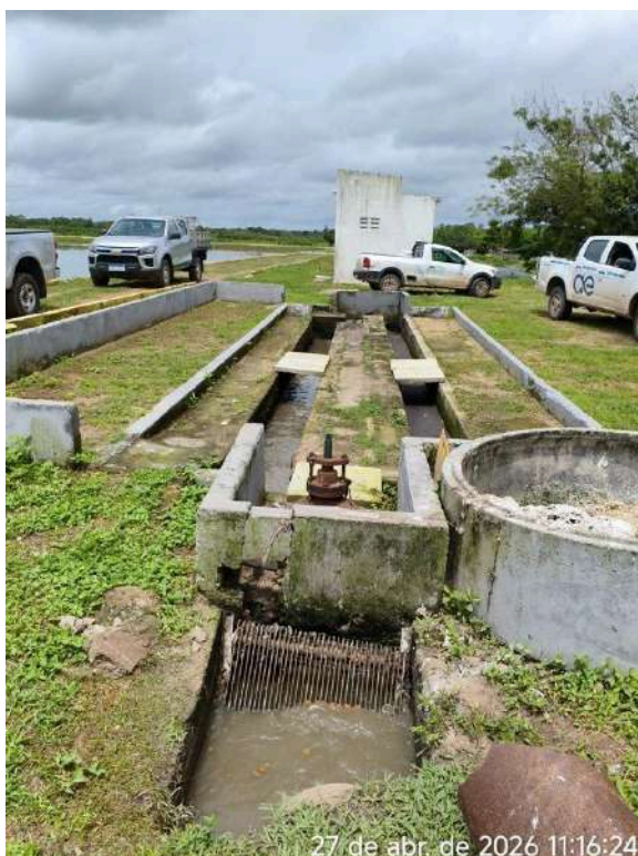
Foto 88- ETE Paraipaba: infraestrutura do tratamento preliminar deteriorada.
