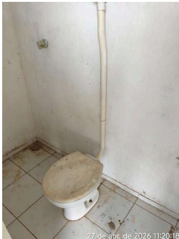
Foto 94- ETE Paraipaba: banheiro com sujeiras.
