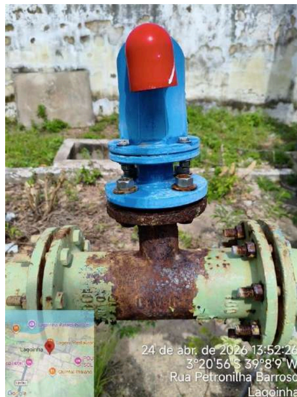
Foto 76 - PT-03 (Lagoinha): tubulação em processo de corrosão.
