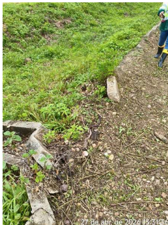
Foto 106 - ETE Lagoinha : taludes com meio-fio e drenagem de água comprometidos.
