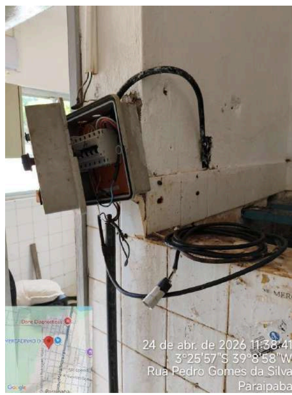
Foto 60 - ETA Paraipaba: casa de química com quadro de disjuntores danificado e fiação exposta.
