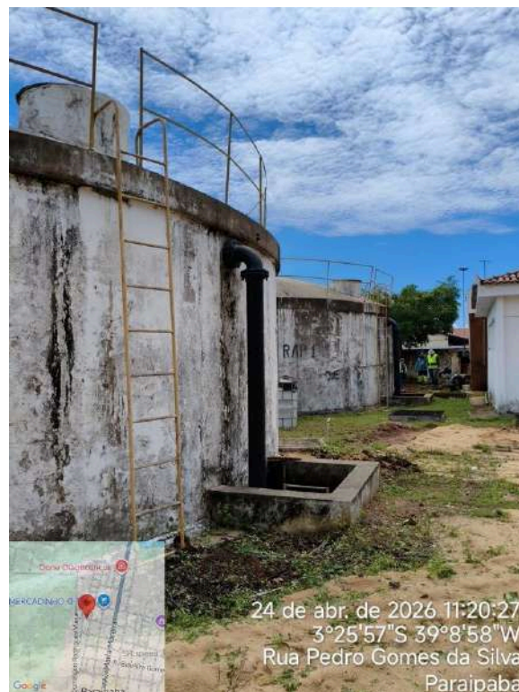
Foto 56 - ETA Paraipaba: RAP-01 e RAP-02 com pintura e identificação desgastados.
