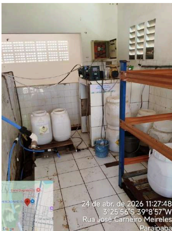
Foto 9 - ETA Paraipaba: casa de química com fiação sem proteção, sujeidade.
