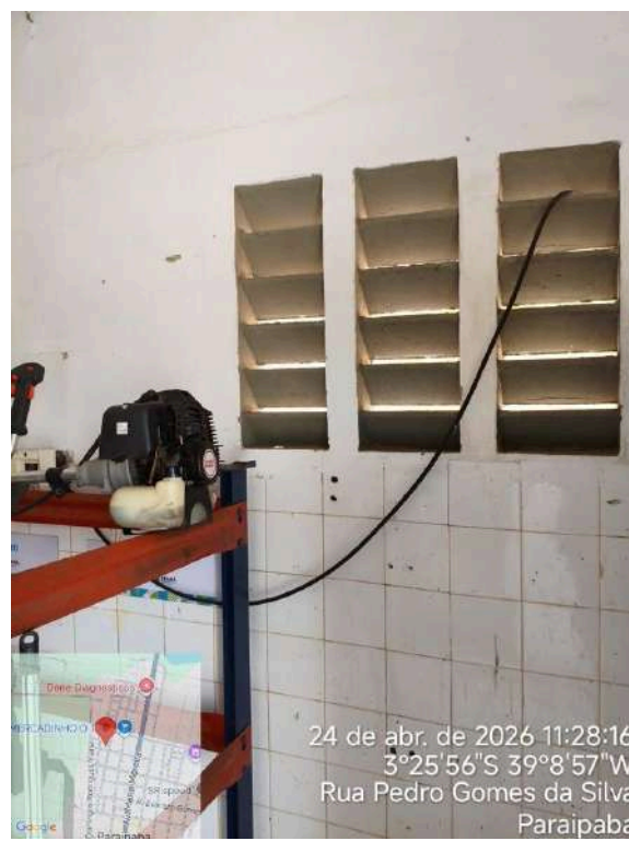
Foto 10 - ETA Paraipaba: casa de química com fiação sem proteção, através de cobogó.
