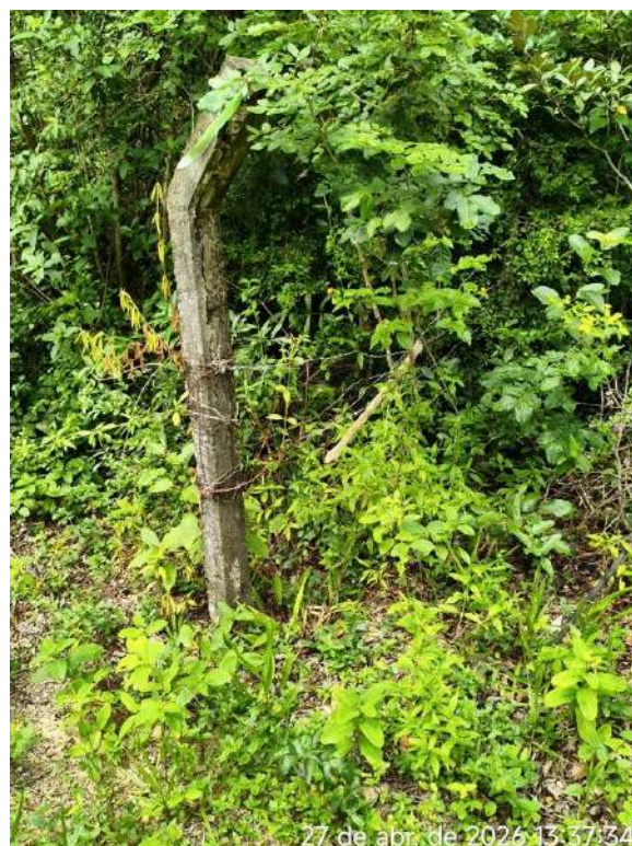
Foto 108 - ETE Lagoinha : cerca de proteção possui aberturas e partes danificadas.
