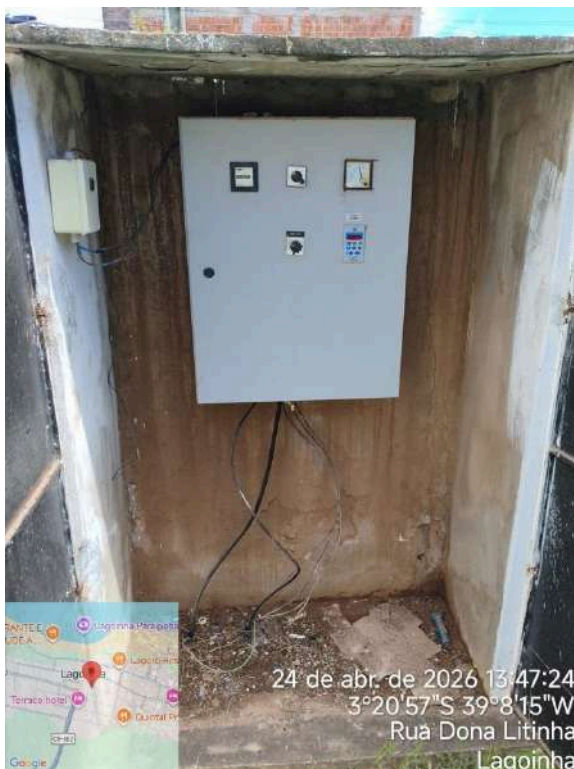
Foto 21 - PT-02 (Lagoinha): fiação do quadro de comando sem eletrodutos.
