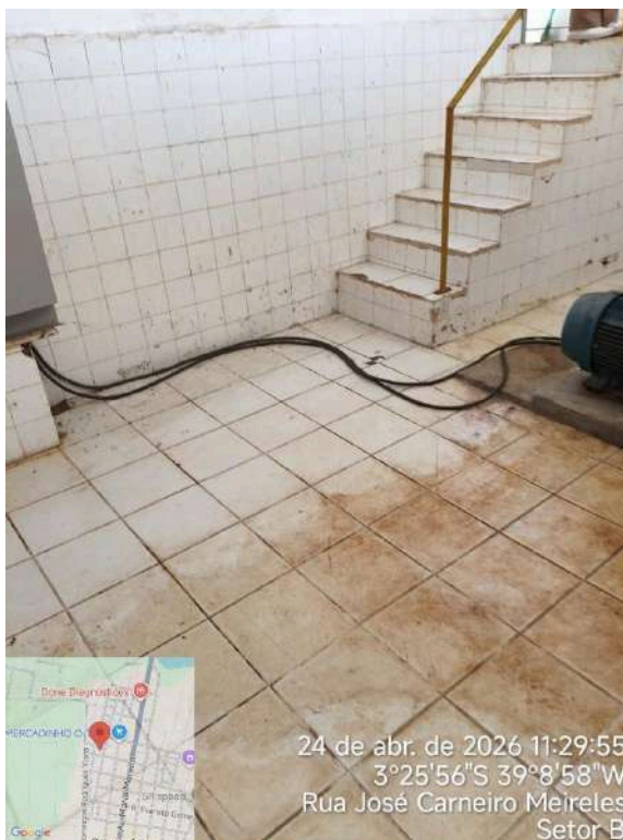
Foto 11 - ETA Paraipaba: casa de bombas com fiação exposta sobre o piso e sem proteção.
