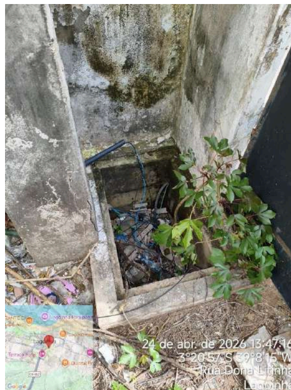
Foto 20 - PT-02 (Lagoinha): fiação solta sem eletrodutos, caixa sem grade/tampa.
