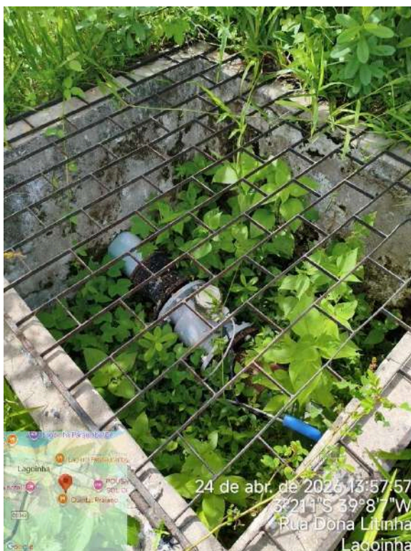
Foto 81 - ETA Lagoinha: vegetação crescida nas caixas de proteção e inspeção.
