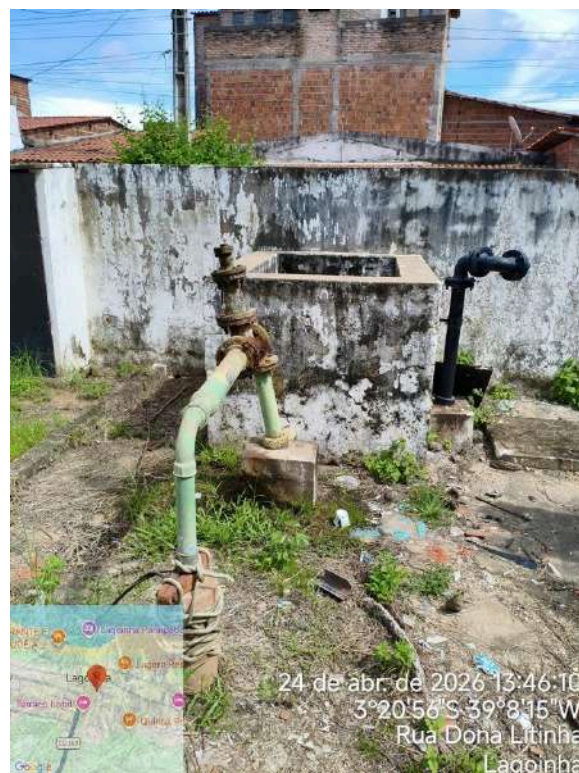
Foto 66 - PT-02 (Lagoinha): pintura deteriorada das paredes e estruturas.
