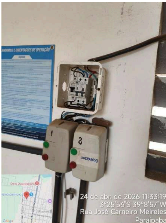
Foto 15 - ETA Paraipaba: casa de cloro com caixa de disjuntores sem tampa.
