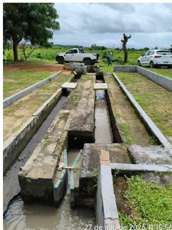
Foto 89- ETE Paraipaba: infraestrutura do tratamento preliminar deteriorada.
