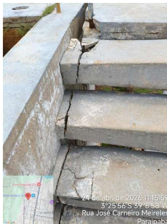
Foto 54 - ETA Paraipaba: escada de acesso deteriorada.
