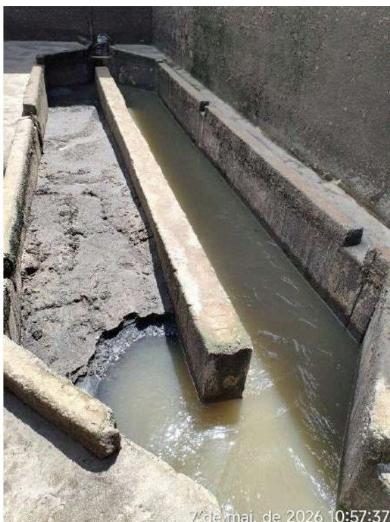
Foto 104 - EEE-01: caixa de areia assoreada e danificada.
