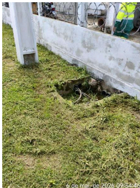
Foto 2 - Captação / Pátio: caixa desprovidas de tampa.
