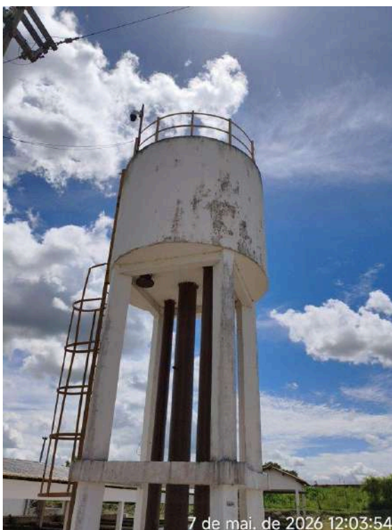
Foto 56 - ETE: Caixa divisória de fluxo (torre de separação) com sistema de pára-raios defeituoso.
