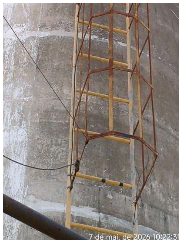
Foto 41 - REL e RAP ( José Lino 4): presença de fiações e cabos elétricos fixados incorretamente à infraestrutura da escada .
