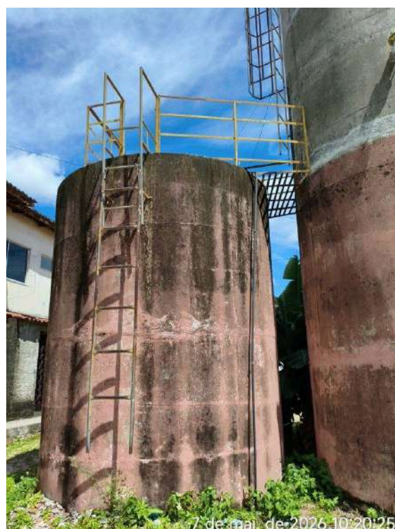
Foto 43 - REL e RAP ( José Lino 4): escada de acesso ao RAP desprovida de gaiola de proteção.
