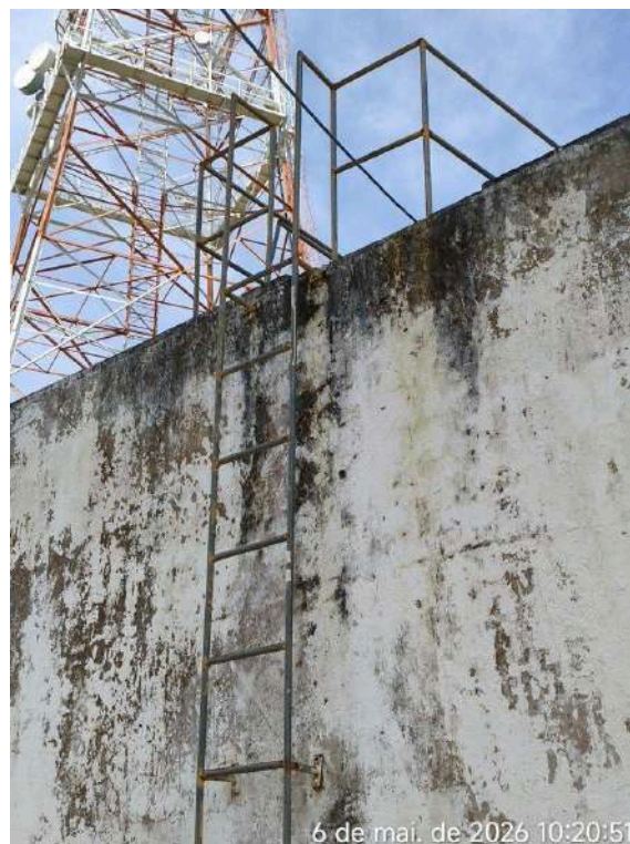
Foto 16 - Filtros F-08 ao F-13: apresentam escadas de acesso inadequadas.
