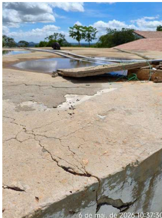
Foto 74 - ETA / RAP-03: com pintura deteriorada e patologias estruturais graves, caracterizadas pela ameaça de desmoronamento de sua laje.
