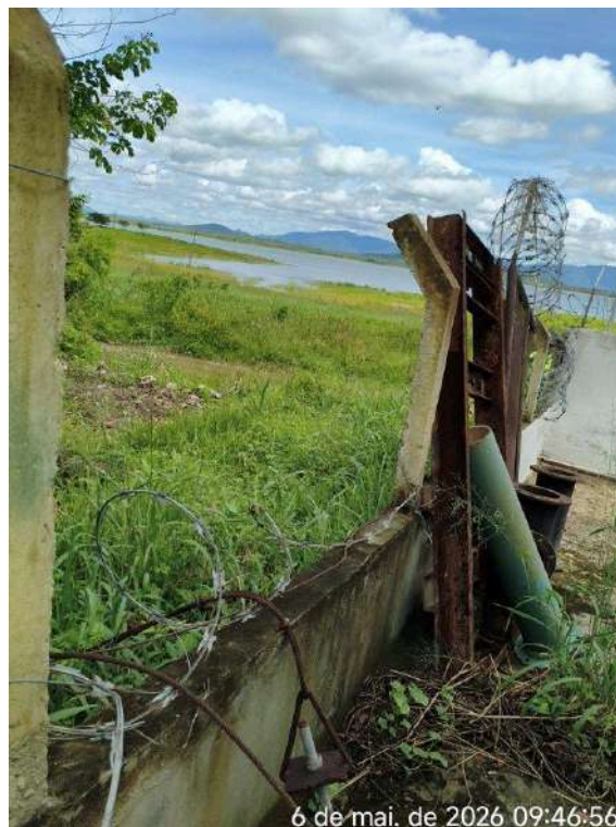
Foto 59 - Captação / Pátio: barreiras perimetrais danificadas (cerca de proteção danificada).
