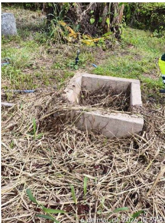
Foto 15 - ETA / Pátio: caixas de proteção e inspeção desprovida de tampa protetora.
