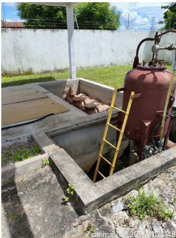
Foto 54 - EEE-05: Fosso de instalação de registros desprovido de tampas ou grades de proteção.
