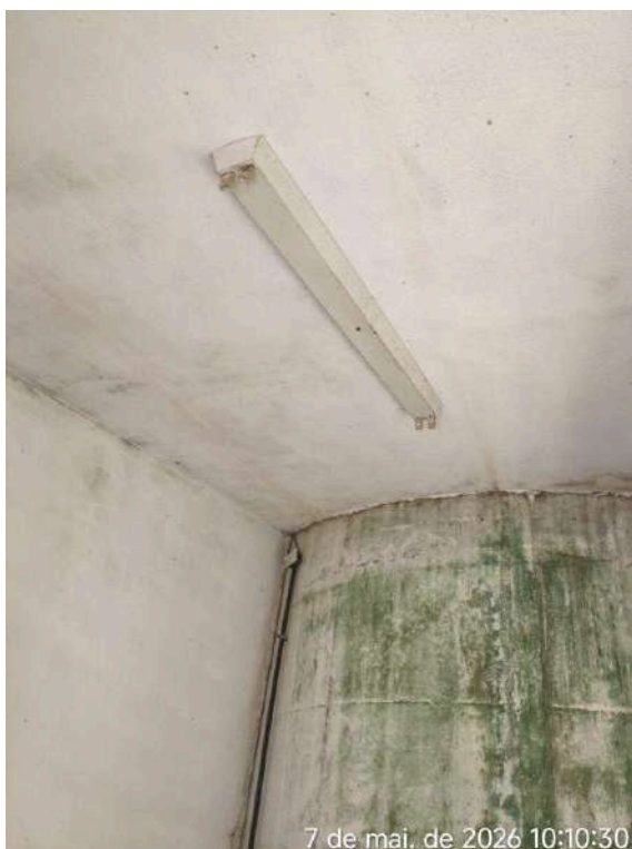
Foto 95 - REL / RAP (José Lino 3): pintura geral deteriorada.
