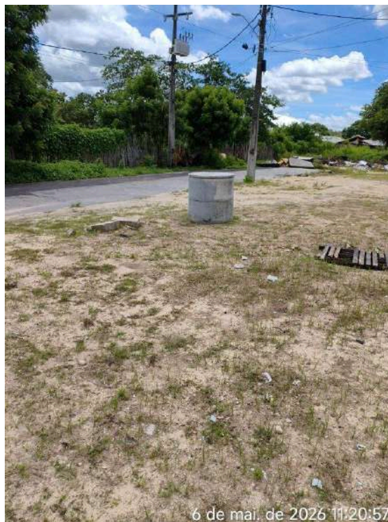
Foto 30 - PT-06: Ausência de identificação do poço.
