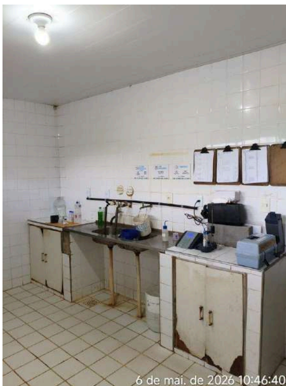
Foto 77 - ETA / laboratório: infraestrutura deteriorada, armários e bancada.
