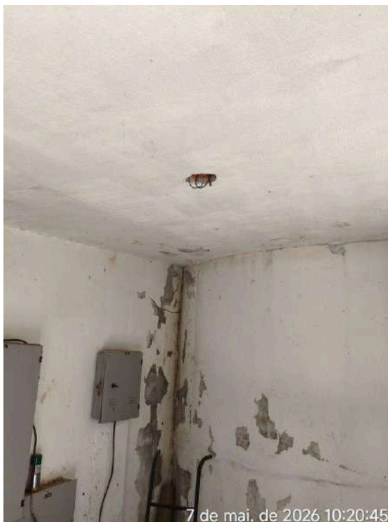
Foto 98 - REL / RAP (José Lino 4): rachaduras na edificação da casa de bombas, ausência de lâmpada.
