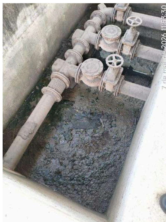
Foto 53 - EEE-04: Fossos dos registros e equipamentos desprovido de tampas ou grades de proteção.
