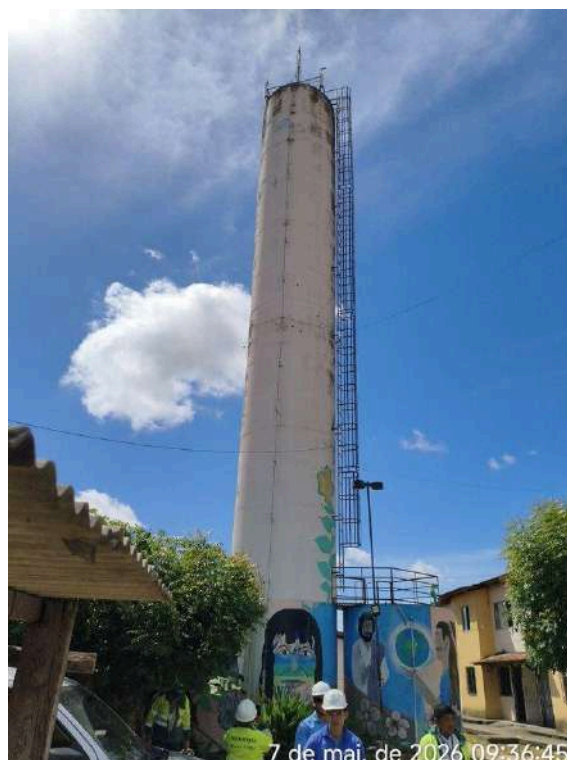
Foto 88 - REL / RAP (José Lino 1): pintura geral deteriorada e escada de acesso em processo avançado de corrosão.
