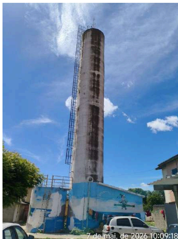
Foto 96 - REL / RAP (José Lino 3): pintura geral deteriorada e escada de acesso em processo avançado de corrosão.
