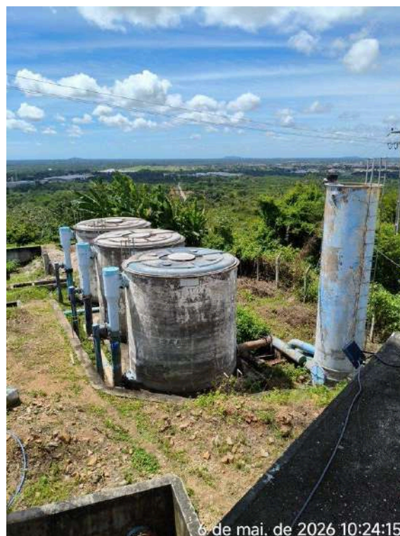
Foto 18 - ETA / Filtros: F-05 ao F-07 apresentam escadas de acesso inadequadas.
