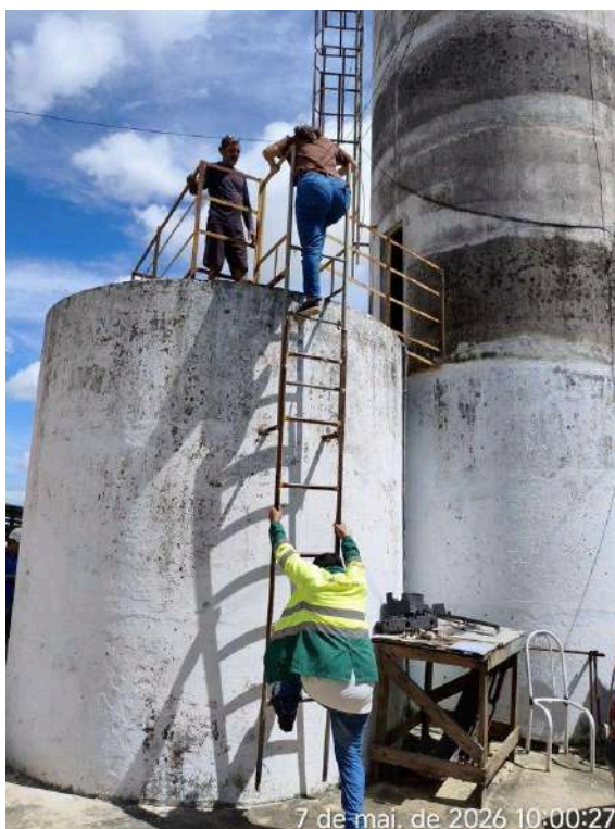
Foto 36 - REL e RAP ( José Lino 2): escada de acesso ao RAP desprovida de gaiola de proteção.
