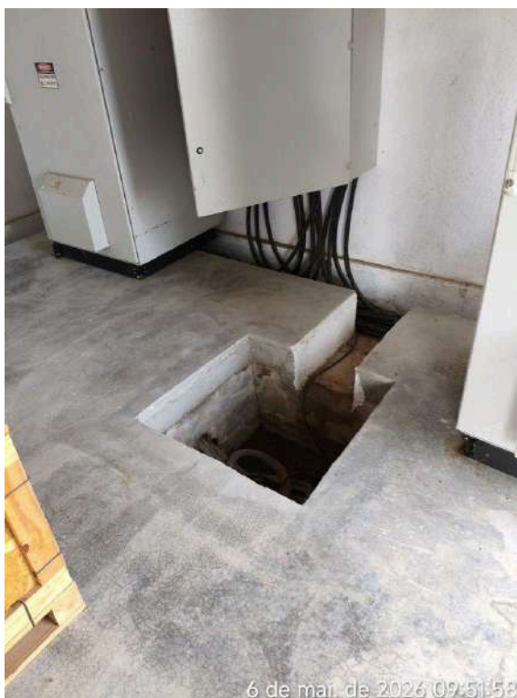
Foto 5 - Casa dos Quadros de Comando: caixas de proteção e inspeção desprovidas de tampas protetoras.
