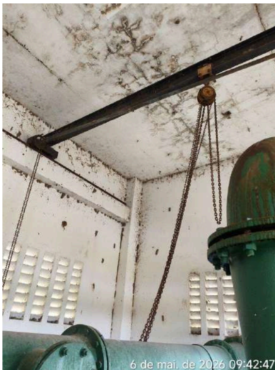
Foto 62 - Captação / EEAB-01: pintura das paredes e do teto desgastada e deteriorada.
