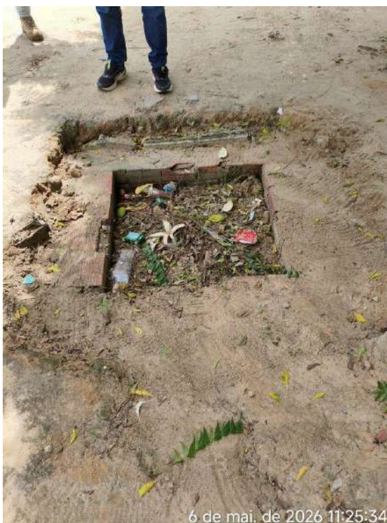
Foto 33 - PT-07: Caixa de registro desprovida de tampa protetora.
