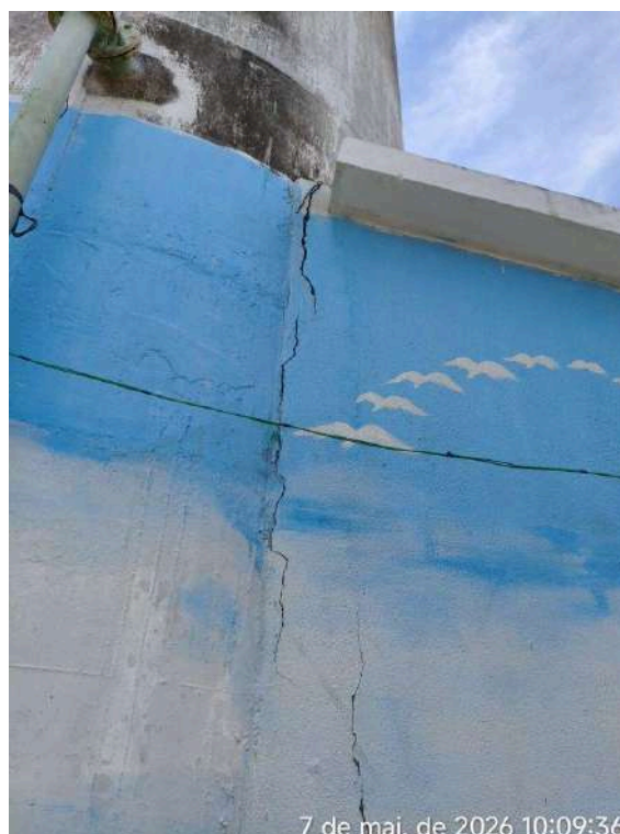
Foto 94 - REL / RAP (José Lino 3): rachaduras na edificação da casa de bombas.
