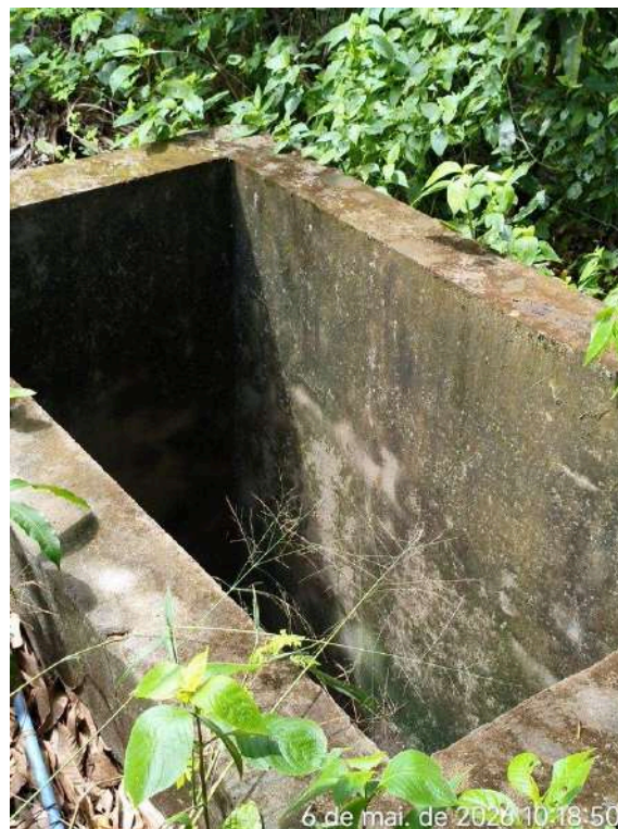
Foto 10 - ETA / Pátio: caixa de proteção e inspeção desprovida de tampa protetora.
