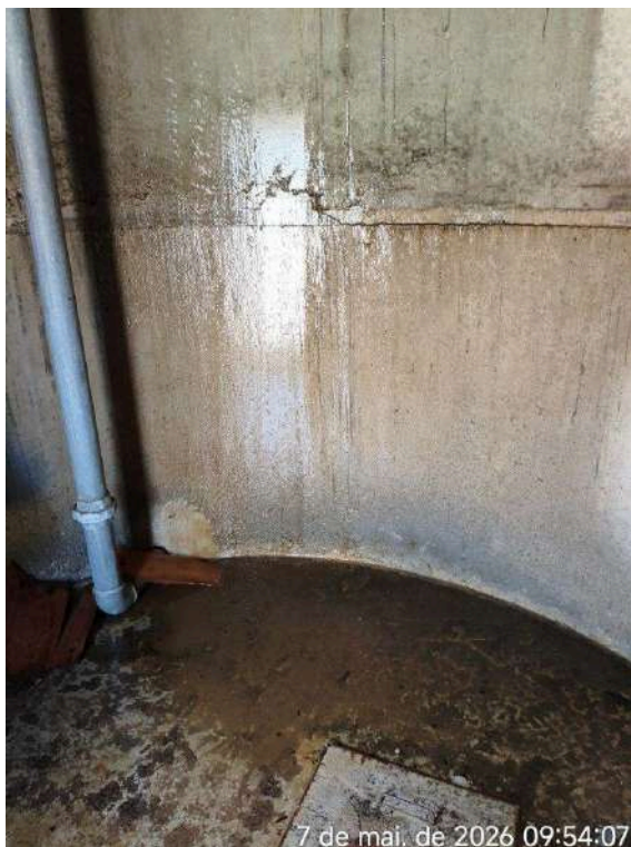
Foto 91 - REL / RAP (José Lino 2): presença de vazamentos na estrutura.
