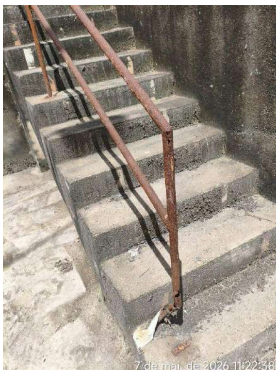
Foto 108 - EEE-05: corrimão da escada de acesso ao fosso em processo avançado de corrosão.
