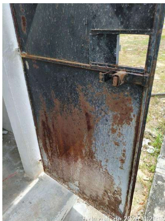
Foto 84 - PT-06: portão de acesso da casa de cloro em processo avançado de corrosão.
