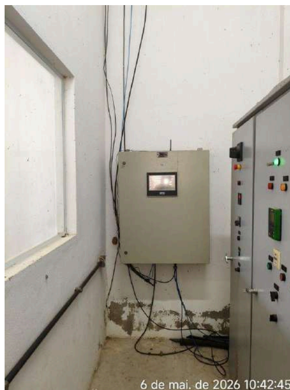
Foto 24 - ETA / EELF-01: Instalações elétricas precárias, sem a devida infraestrutura de proteção.
