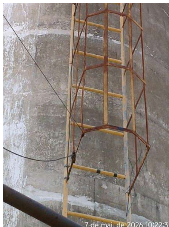
Foto 101 - REL / RAP (José Lino 4): pintura deteriorada e escada de acesso em processo avançado de corrosão.
