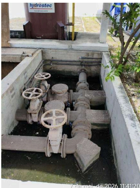
Foto 52 - EEE-03: Fosso dos registros e equipamentos desprovido de tampas ou grades de proteção.
