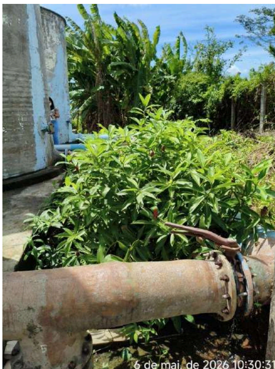
Foto 71 - ETA / Filtros: F-05 a F-07 com presença de proliferação de vegetação sem a devida manutenção..
