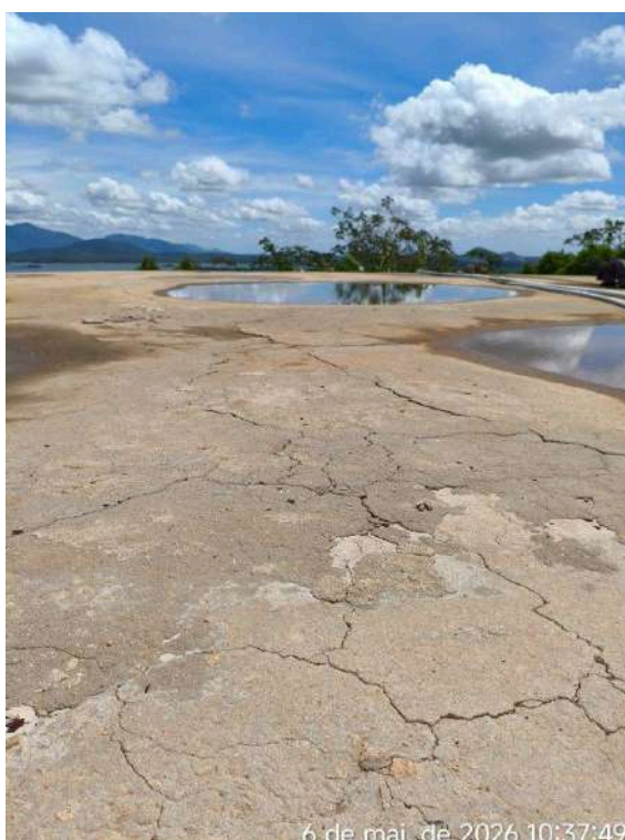
Foto 75 - RAP-03: com pintura deteriorada e patologias estruturais graves, caracterizadas pela ameaça de desmoronamento de sua laje.
