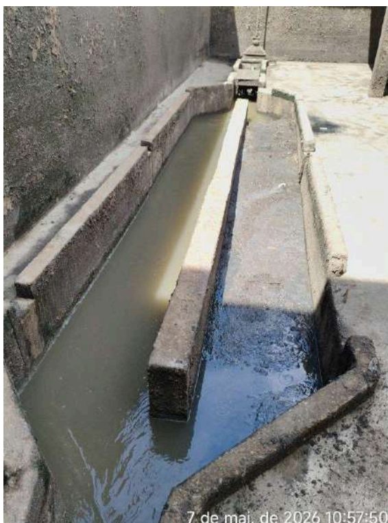
Foto 48 - EEE-01: Indisponibilidade das comportas deslizantes dos canais das caixas de areia.
