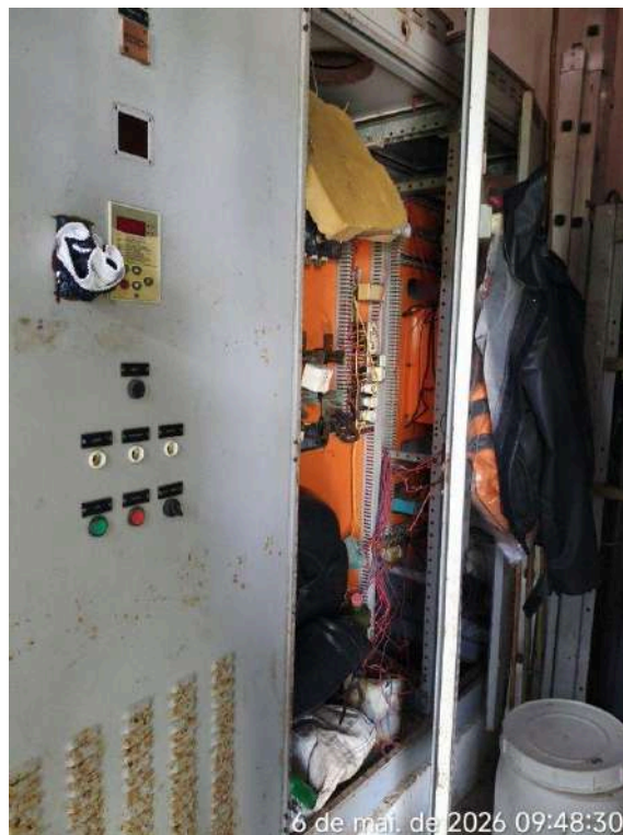
Foto 67 - Captação / Casa de apoio: quadros elétricos desativados que foram abandonados.
