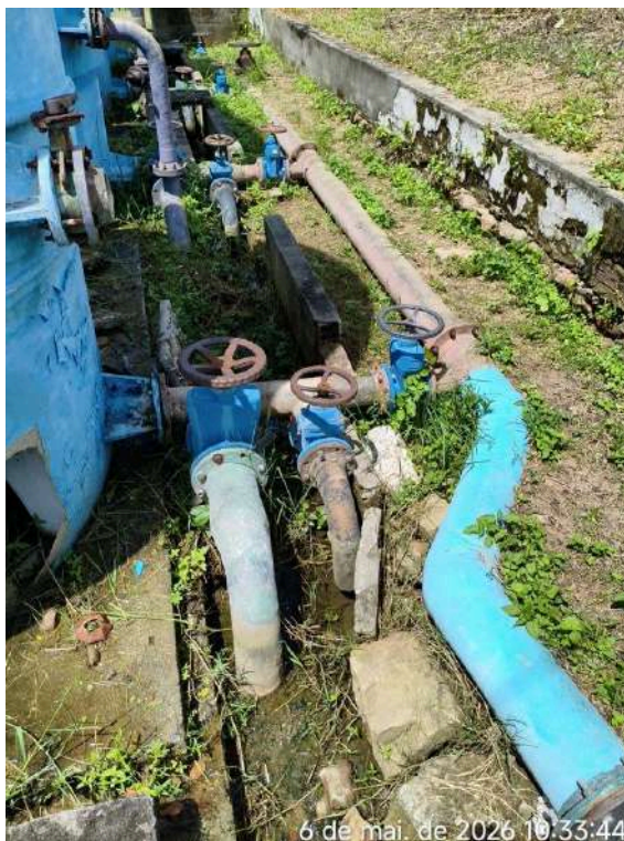
Foto 73 - ETA / Filtros: calha de drenagem dos filtros F-01 a F-04 em estado deteriorado.
