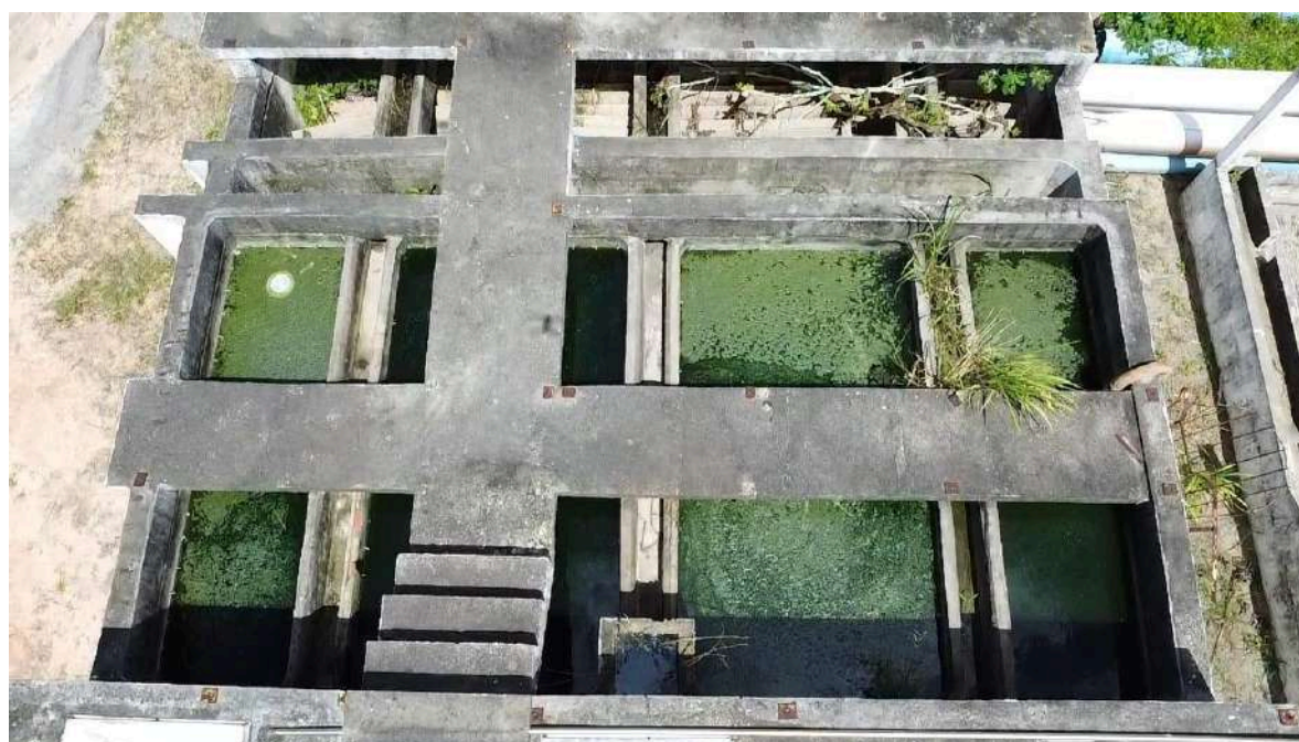
Foto 119 - ETE / ETE Desativada: não consta no croqui, mas não houve desmonte, configurando passivo ambiental, favorecendo acúmulo de água de chuva e desenvolvimento de vetores de doenças.
