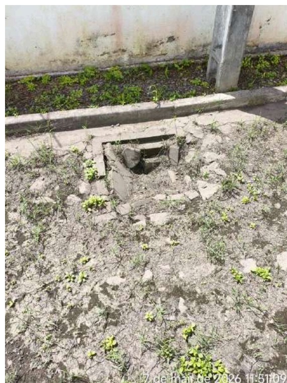
Foto 109 - EEE-04: Caixa de passagem elétrica com tampa danificada.
