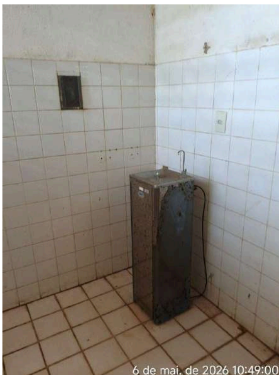
Foto 81 - ETA / refeitório / sala de apoio: com ausência de mobiliário adequado para o uso dos funcionários.
