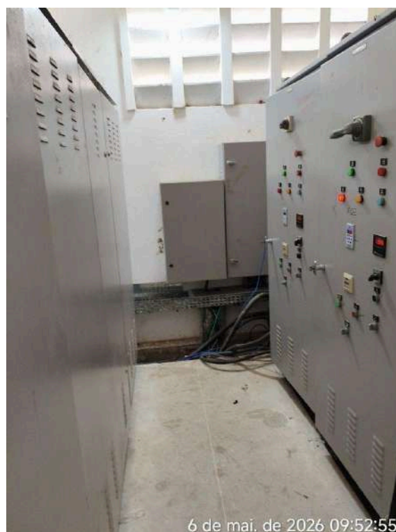
Foto 8 - Casa dos Quadros de Comando: calhas de instalações elétricas e desprovidas de tampas e sem proteção adequada.
