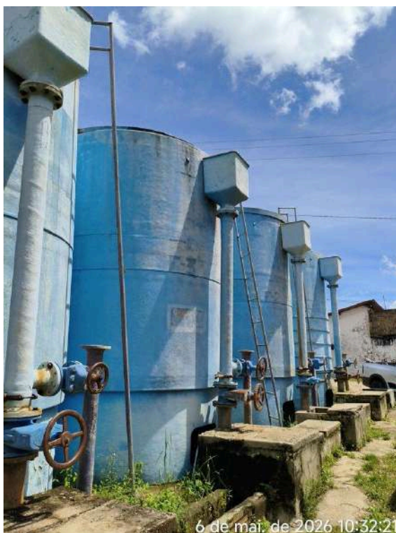
Foto 17 - ETA / Filtros: F-01 ao F-04 apresentam escadas de acesso inadequadas.
