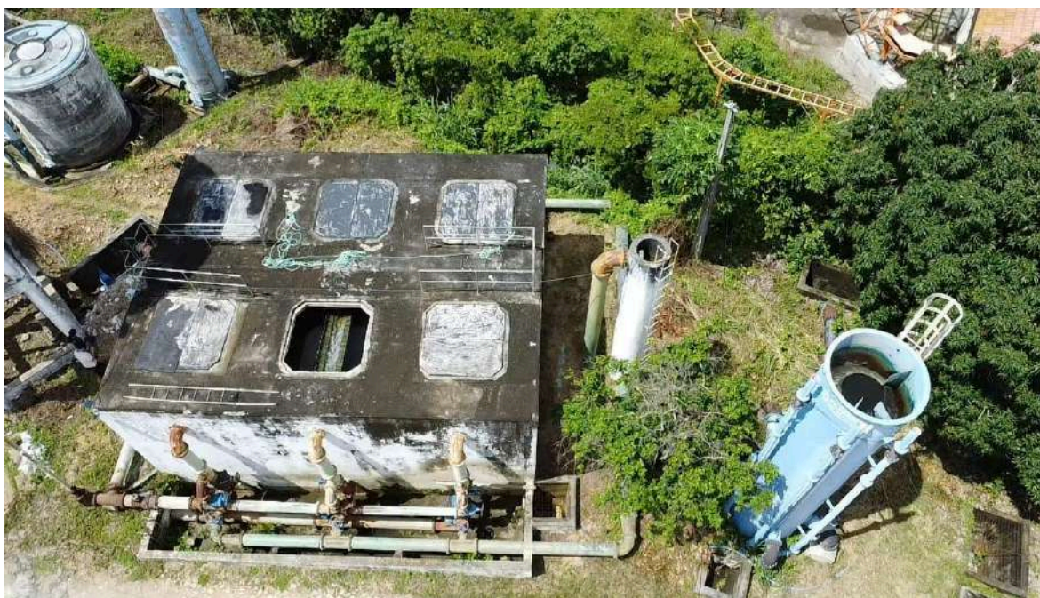
Foto 68 - ETA / Filtros: F-08 a F13 apresentam pintura deteriorada.
