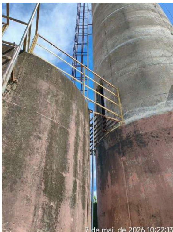
Foto 100 - REL / RAP (José Lino 4): pintura deteriorada e escada de acesso em processo avançado de corrosão.
