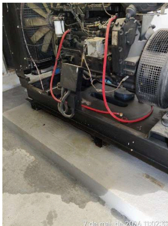
Foto 105 - EEE-01: casa do grupo gerador com vazamento de óleo combustível sobre o piso.
