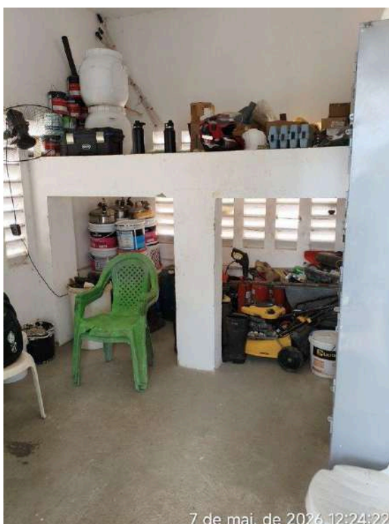
Foto 116 - ETE / Sala de Química: sendo utilizada para depósito improvisado de outros equipamentos.
