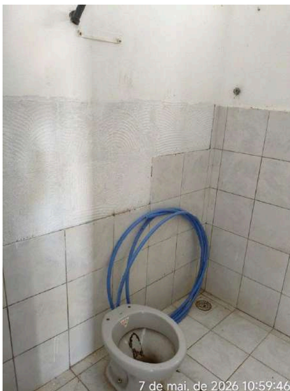
Foto 50 - EEE-01: banheiro inoperante com ausência de iluminação e componentes hidráulicos incompletos.
