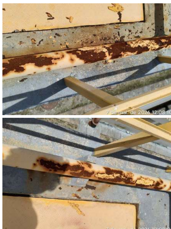
Foto 113 - ETE / UASB: apresenta tubulação de gases danificada e em processo avançado de corrosão.
