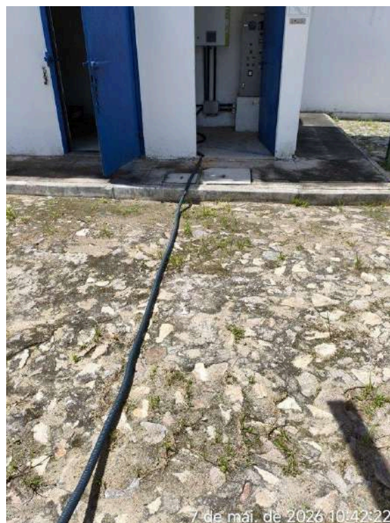
Foto 47 - EEE-06: Instalações elétricas improvisadas e sem o devido isolamento.
