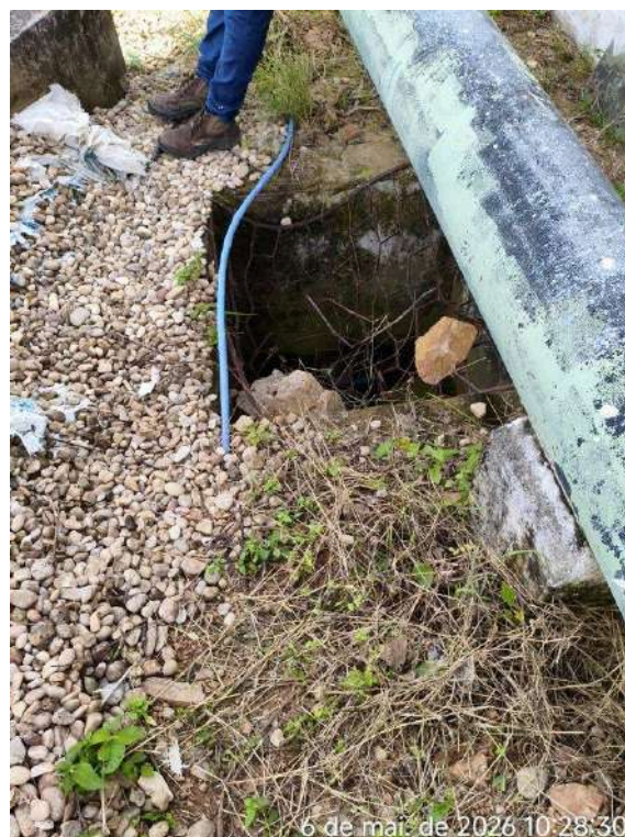
Foto 12 - ETA / Pátio: caixa de proteção e inspeção desprovida de tampa protetora.
