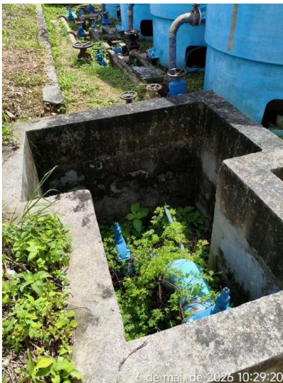
Foto 13 - ETA / Pátio: caixa de proteção e inspeção desprovida de tampa protetora.
