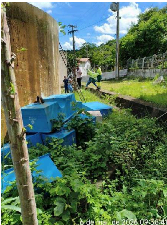
Foto 58 - Captação / Pátio: estrutura com pintura deteriorada, área do pátio com proliferação de vegetação e materiais armazenados de forma improvisada e desordenada.
