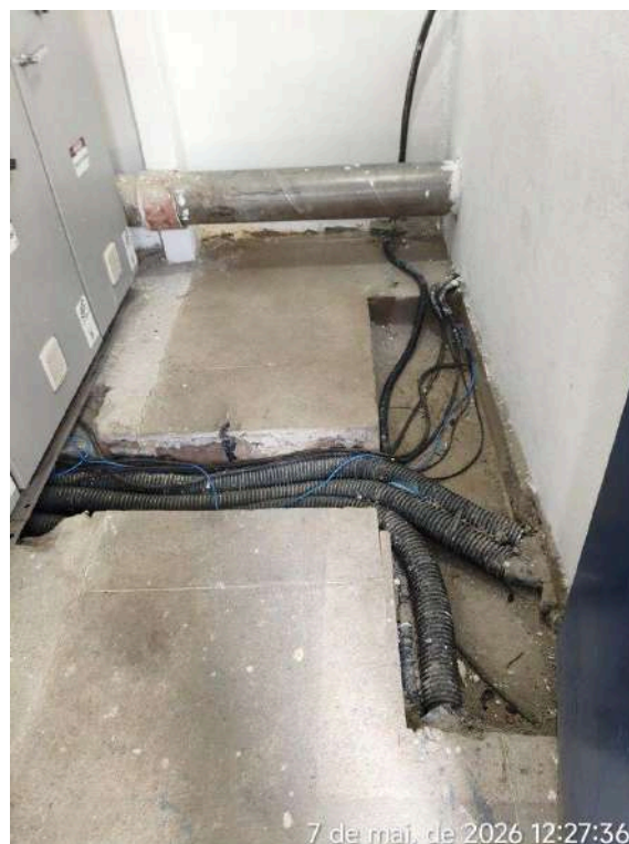
Foto 57 - ETE: sala do quadro de comando apresenta calha de piso sem grelha / tampa de proteção.
