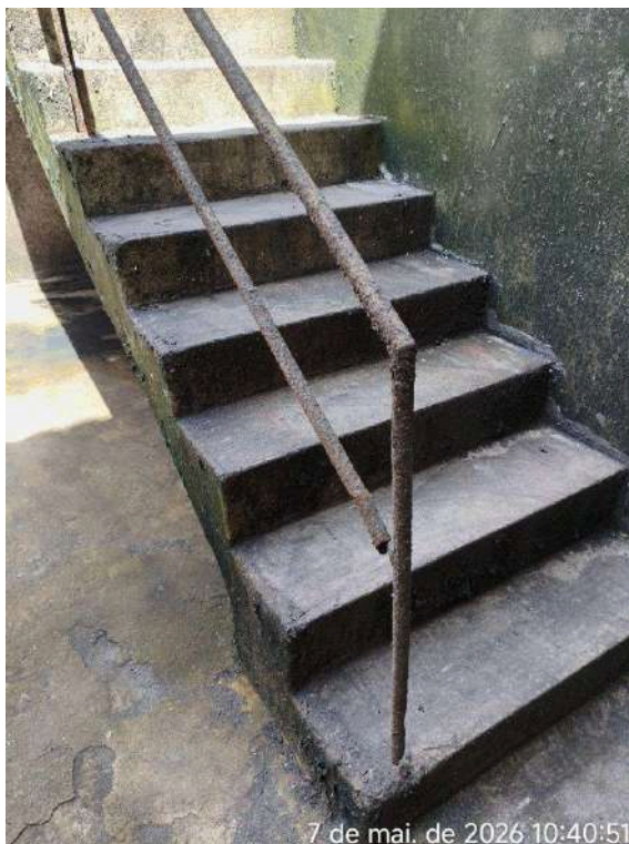
Foto 102 - EEE-06: corrimão da escada de acesso ao fosso de tratamento preliminar danificado.
