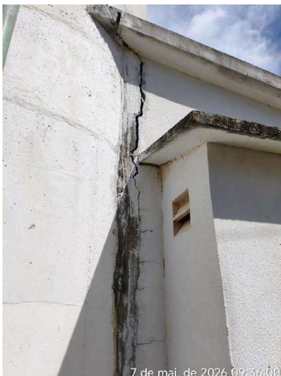
Foto 87 - REL / RAP (José Lino 1): patologias estruturais caracterizadas por rachaduras na edificação da casa de bombas.
