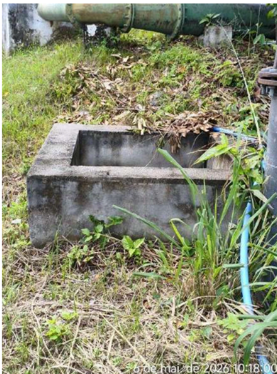
Foto 9 - ETA / Pátio: caixa de proteção e inspeção desprovida de tampa protetora.
