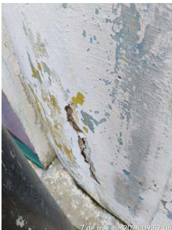
Foto 93 - REL / RAP (José Lino 2): presença de vazamentos na estrutura e rachaduras na casa de bombas.
