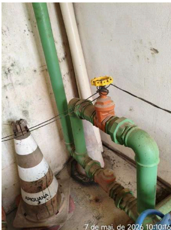
Foto 38 - REL e RAP ( José Lino 3): Instalações elétricas sem eletrodutos de proteção e isolamento, fixadas no registro de manobra.
