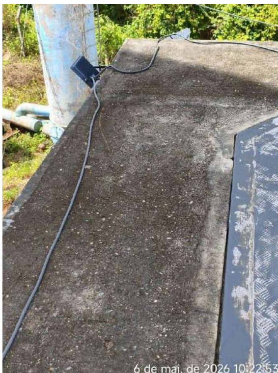
Foto 19 - ETA / Filtros: F-08 ao F-13 com instalações elétricas inadequadas.
