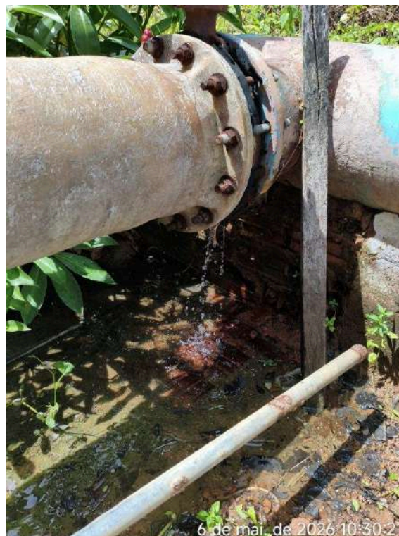
Foto 70 - ETA / Filtros: F-05 a F-07 apresentam vazamentos estruturais.
