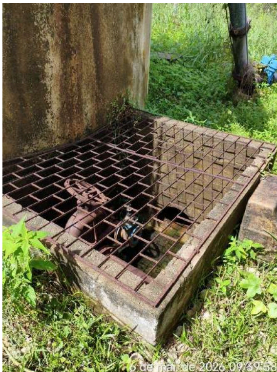
Foto 60 - Captação / RAP-02: registro de saída em processo avançado de corrosão e oxidação.
