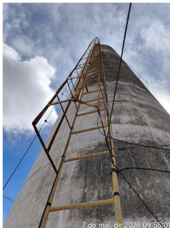
Foto 34 - REL e RAP ( José Lino 2): presença de fiações e cabos elétricos fixados à escada do reservatório elevado.
