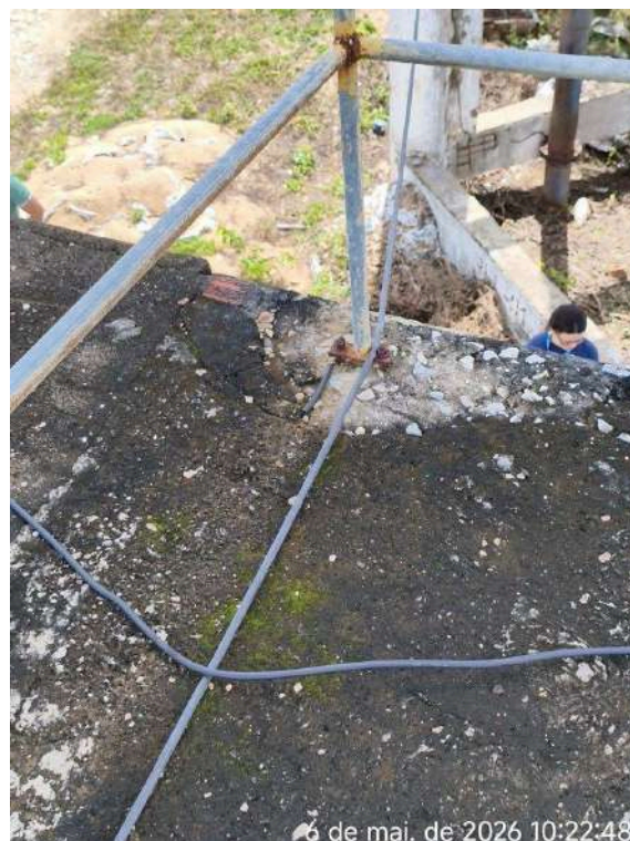
Foto 20 - ETA / Filtros: F-08 ao F-13 com instalações elétricas inadequadas.
