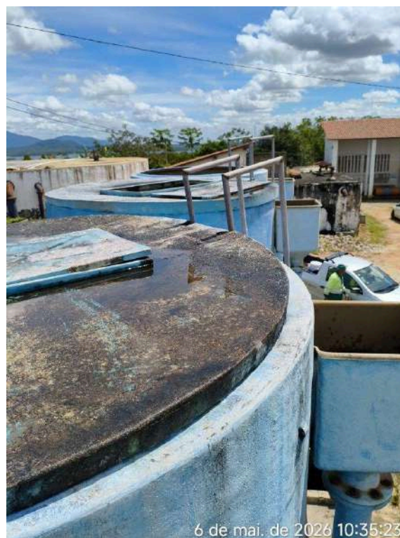
Foto 22 - ETA / Filtros: F-01 a F-04 com ausência de tampas protetoras.
