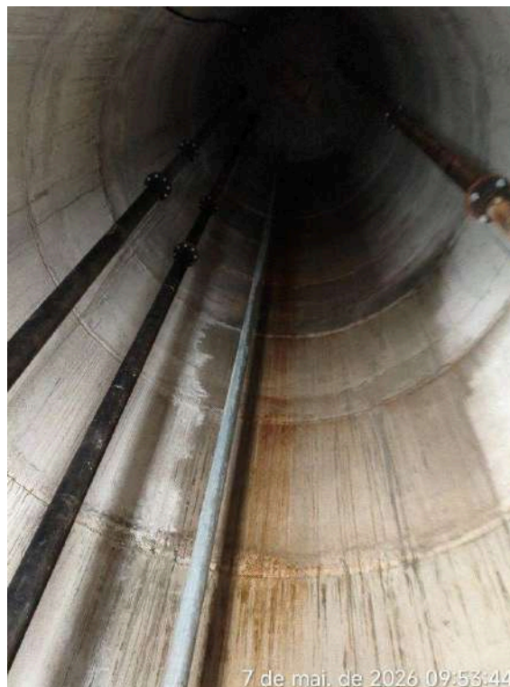
Foto 92 - REL / RAP (José Lino 2): presença de vazamentos na estrutura.
