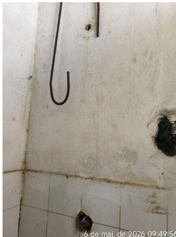
Foto 65 - Captação / Casa de apoio: instalações sanitárias precárias e inoperantes e sujeidade.
