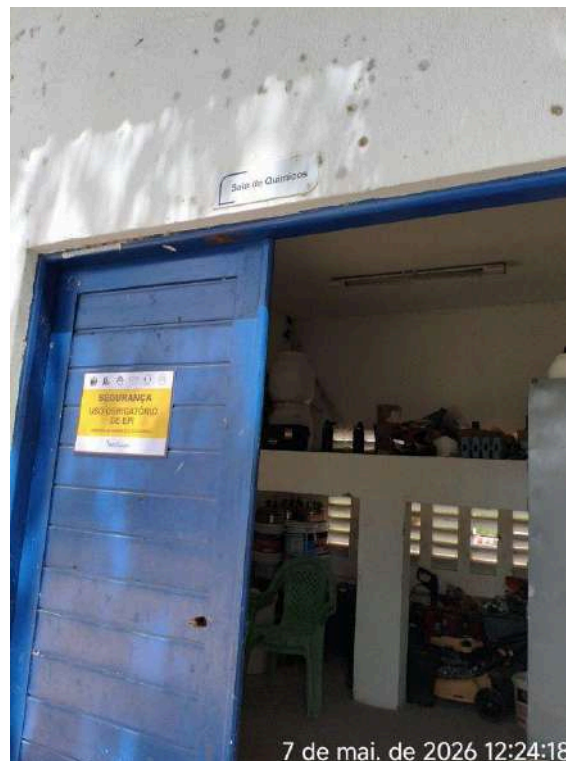
Foto 115 - ETE / Sala de Química: sendo utilizada para depósito improvisado de outros equipamentos.
