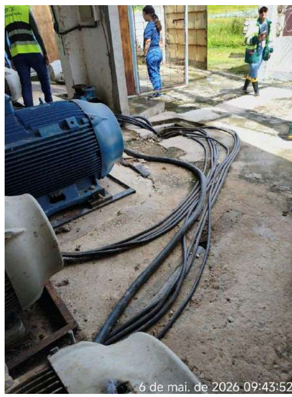
Foto 4 - EEAB-01: Presença de fios/cabos expostos sobre o piso, sem eletrodutos de proteção e isolamento.
