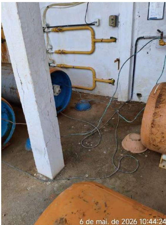
Foto 29 - ETA / Cloração: Instalações elétricas expostas e dispostas diretamente sobre o piso sem eletrodutos de proteção e isolamento.
