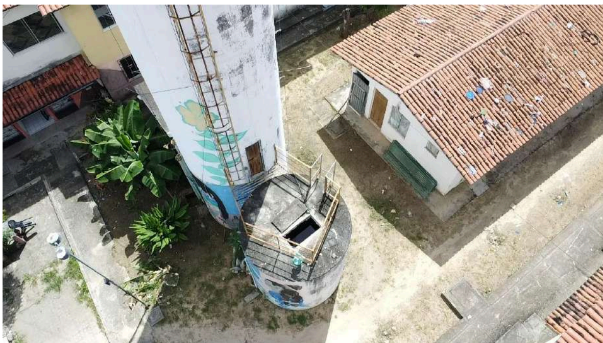
Foto 89 - REL / RAP (José Lino 1): pintura geral deteriorada e escada de acesso em processo avançado de corrosão e tampa do RAP deslocada.
