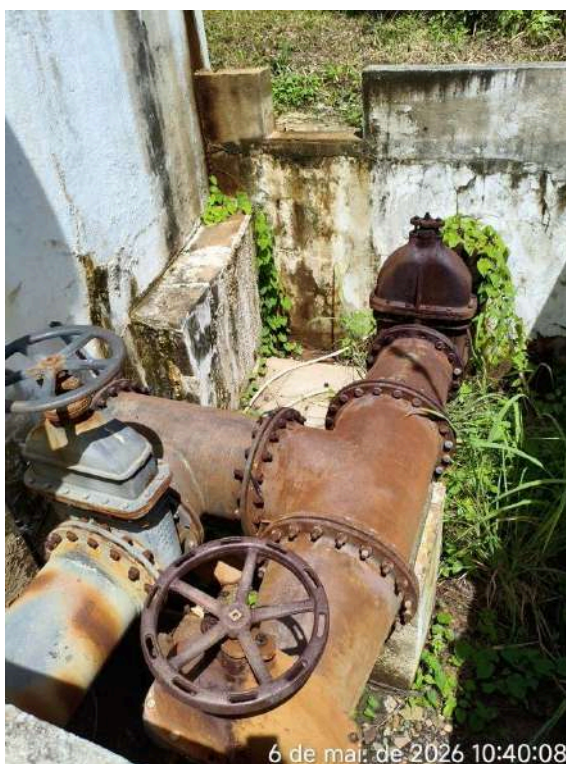
Foto 23 - ETA / RAP-03: Caixas de saída de medição sem escada de acesso.
