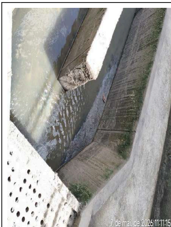
Foto 106 - EEE-02: caixas de areia operando em estado assoreado.
