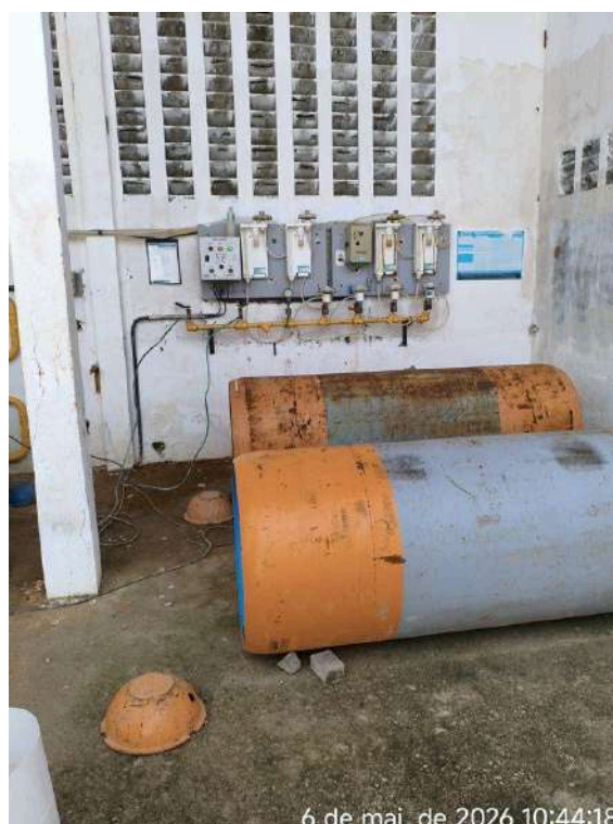
Foto 76 - ETA / cloração: apresenta instalações com acúmulo de sujeira no piso.
