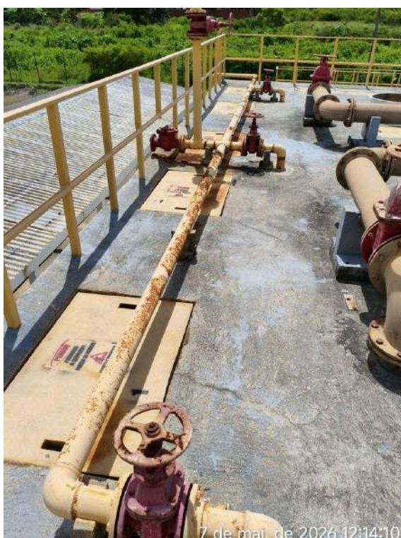
Foto 112 - ETE / UASB: apresenta tubulação de gases danificada e em processo avançado de corrosão.
