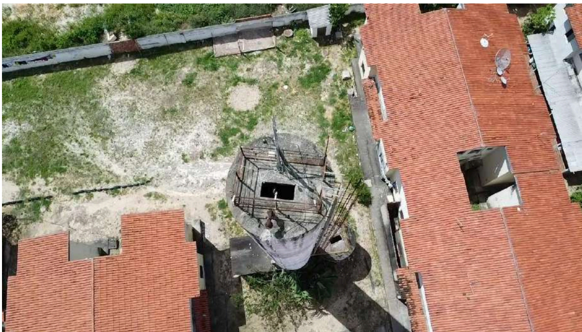
Foto 44 - REL e RAP ( José Lino 4): ausência de tampa nos reservatórios.
