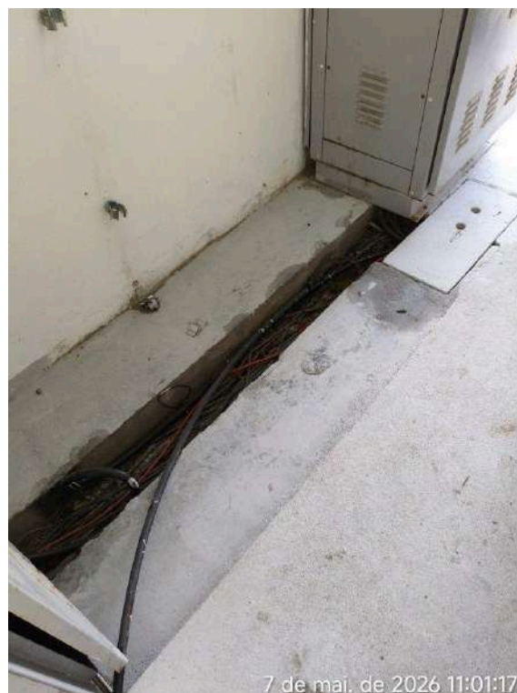
Foto 49 - EEE-01: calha elétrica sem proteção adequada na casa do quadro de comandos.
