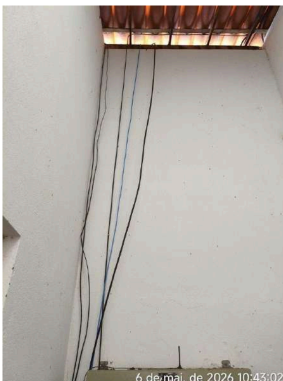
Foto 27 - ETA / EELF-01: Instalações elétricas precárias, sem a devida infraestrutura de proteção.
