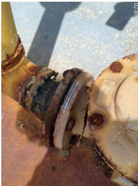
Foto 114 - ETE / UASB: apresenta tubulação de gases danificada e em processo avançado de corrosão.
