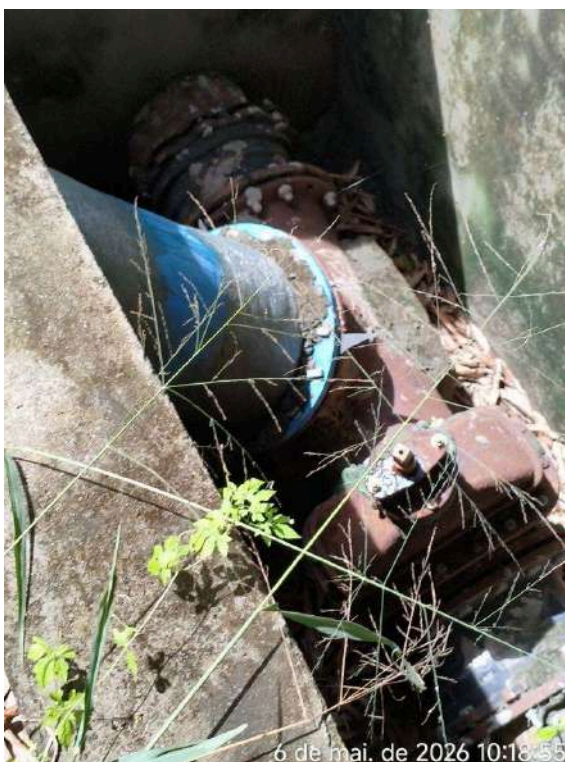
Foto 11 - ETA / Pátio: caixa de proteção e inspeção desprovida de tampa protetora.
