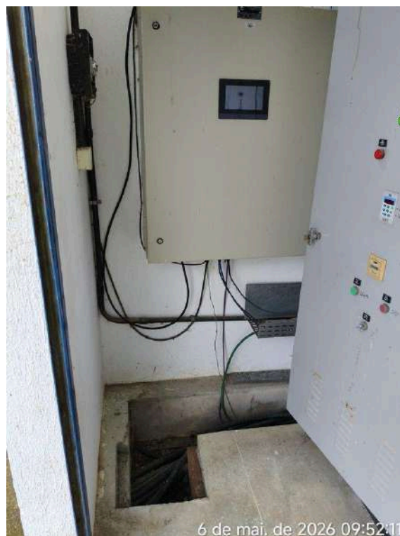
Foto 6 - Casa dos Quadros de Comando: calhas de instalações elétricas e caixas desprovidas de tampas e sem proteção adequada.
