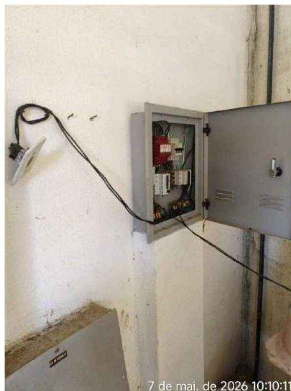
Foto 37 - REL e RAP ( José Lino 3): Instalações elétricas sem eletrodutos de proteção e isolamento, instalada através da tampa do quadro de disjuntores.
