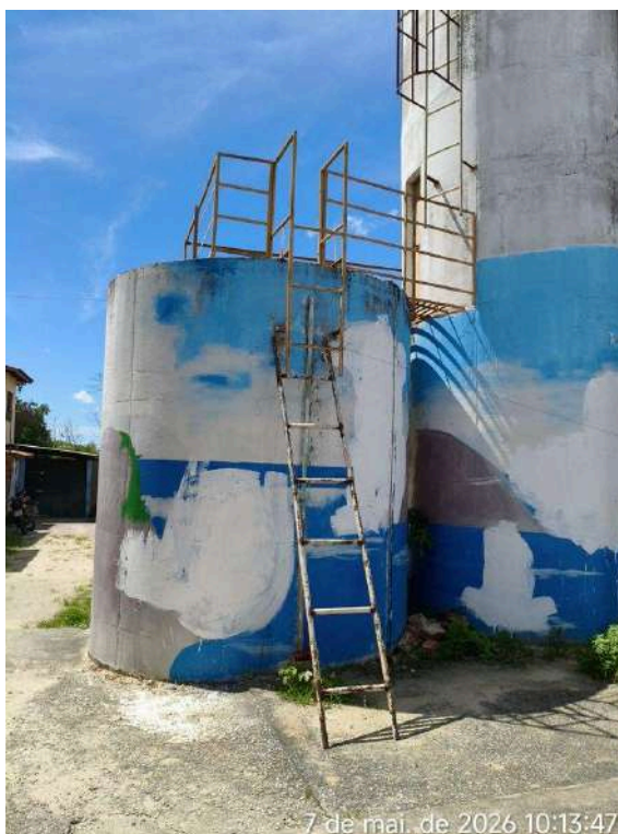
Foto 40 - REL e RAP ( José Lino 3): escada de acesso ao RAP desprovida de gaiola de proteção.
