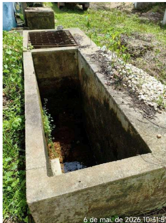
Foto 14 - ETA / Pátio: caixa de proteção e inspeção desprovida de tampa protetora.
