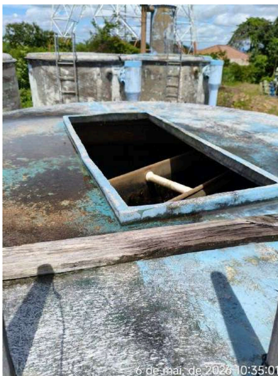
Foto 21 - ETA / Filtros: F-01 a F-04 com ausência de tampas protetoras.
