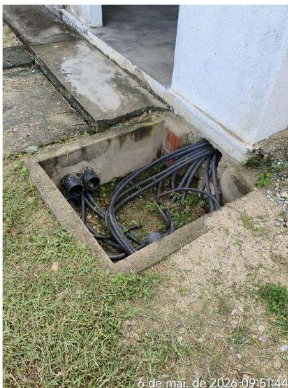
Foto 1 - Captação / Pátio: caixa desprovida de tampa.
