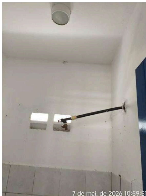
Foto 51 - EEE-01: banheiro inoperante com ausência de iluminação e componentes hidráulicos incompletos.
