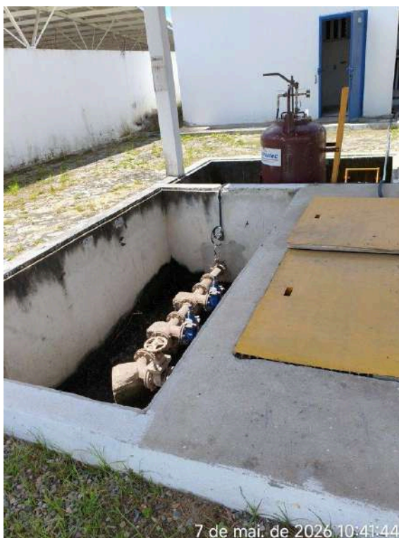
Foto 46 - EEE-06: caixa de inspeção desprovida de tampa / grade de proteção.
