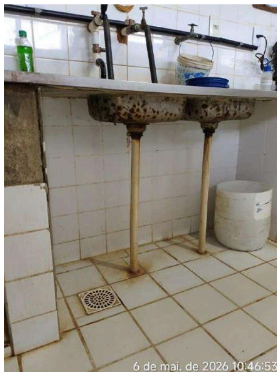
Foto 78 - ETA / laboratório: infraestrutura deteriorada, bancada.
