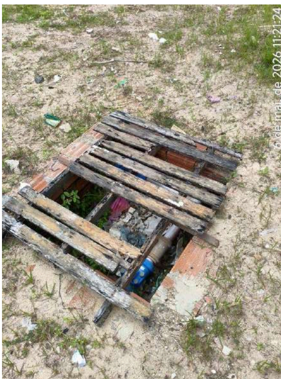
Foto 31 - PT-06: Caixa de registro desprovida de tampa protetora adequada.
