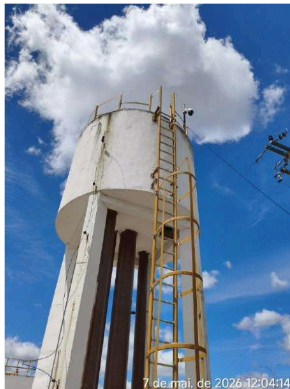
Foto 55 - ETE: Caixa divisória de fluxo (torre de separação) com escada de acesso inadequada.
