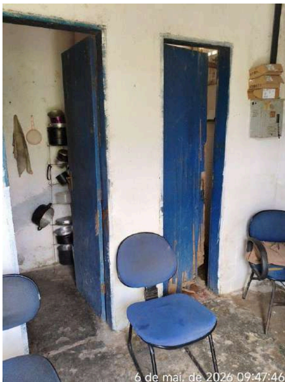
Foto 64 - Captação / Casa de apoio: infraestrutura precária, com deficiência no sistema de iluminação.
