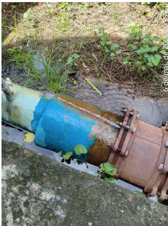
Foto 69 - ETA / Filtros: F-05 a F-07 apresentam vazamentos estruturais.
