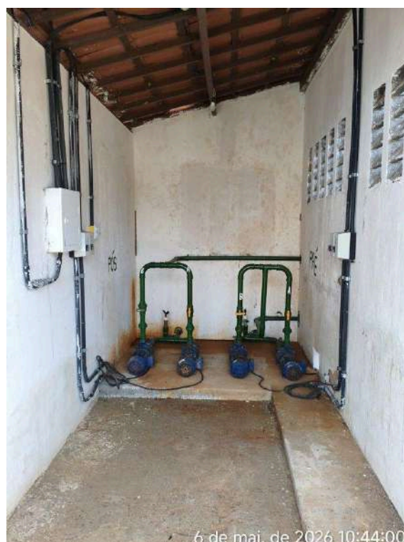
Foto 28 - ETA / Cloração: Instalações elétricas expostas e dispostas diretamente sobre o piso na área de circulação, sem eletrodutos de proteção e isolamento.
