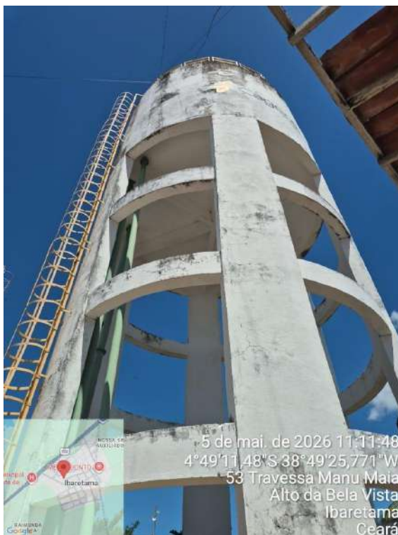
Foto 13 - REL-11: pintura desgastada.
