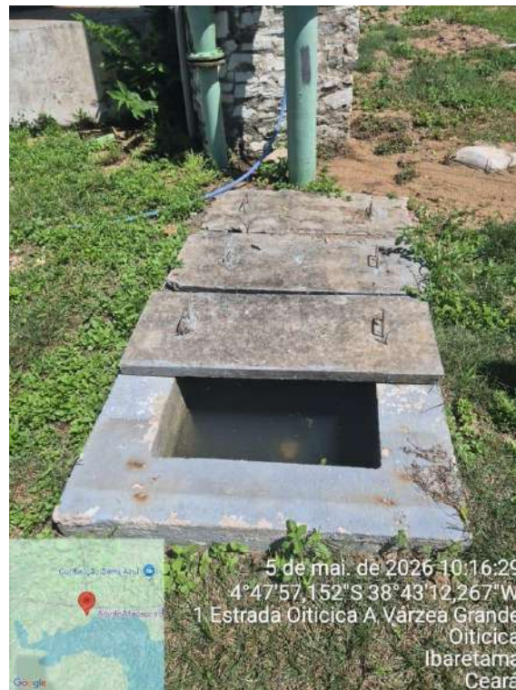
Foto 2 - Pátio da ETA: caixa sem tampa.
