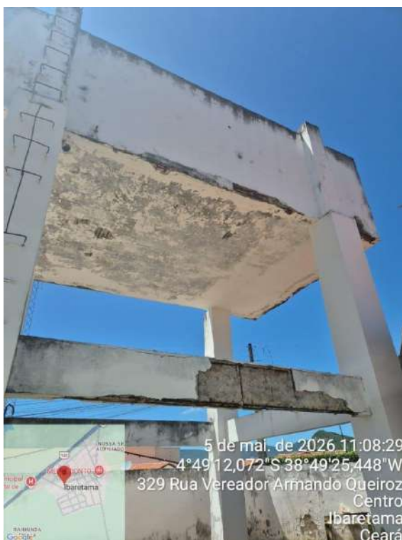
Foto 18 - REL-09: apresenta armaduras expostas nos pilares e ao redor do reservatório.
