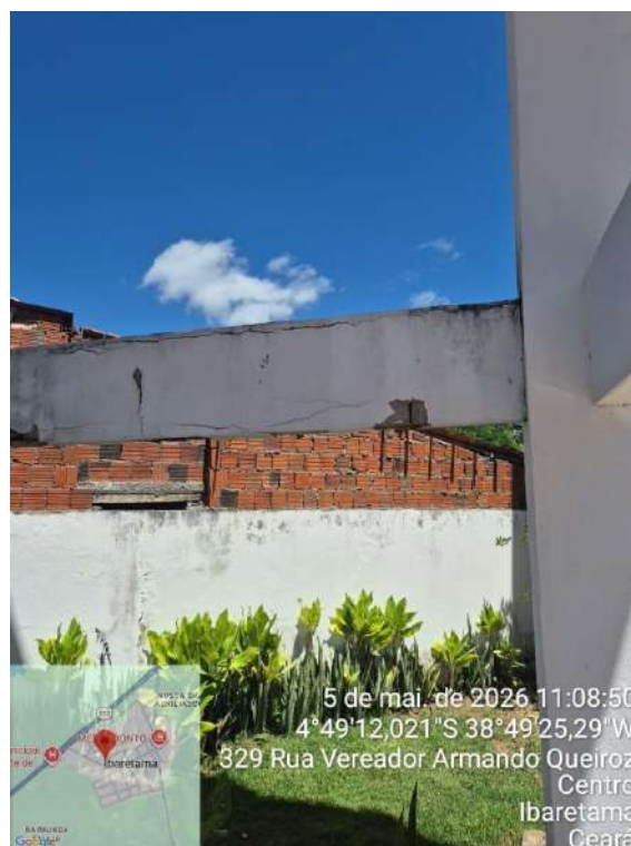
Foto 19 - REL-09: apresenta armaduras expostas nos pilares e ao redor do reservatório.
