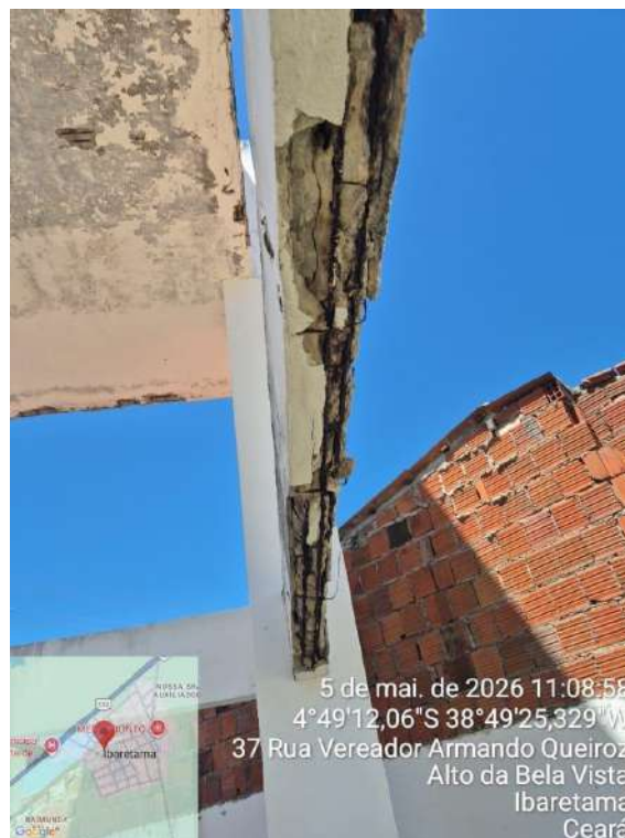
Foto 17 - REL-09: apresenta armaduras expostas nos pilares e ao redor do reservatório.
