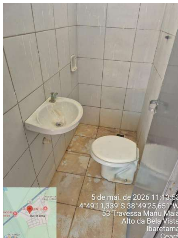
Foto 12 - EEAT-03: banheiro sem descarga do vaso, sem sifão do lavatório e com sujeidade.
