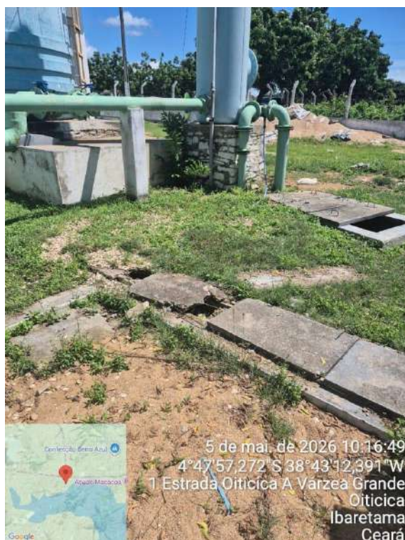
Foto 5 - Pátio da ETA: caixas com tampas quebradas.
