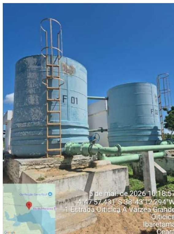
Foto 8 - Filtros (F-01 e F-02): apresentam pinturas desgastadas.
