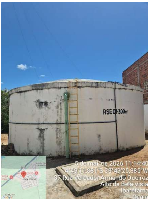
Foto 3 - RSE-01: escada sem gaiola de proteção e sem grade de proteção do patamar superior / laje de cobertura; pintura deteriorada.
