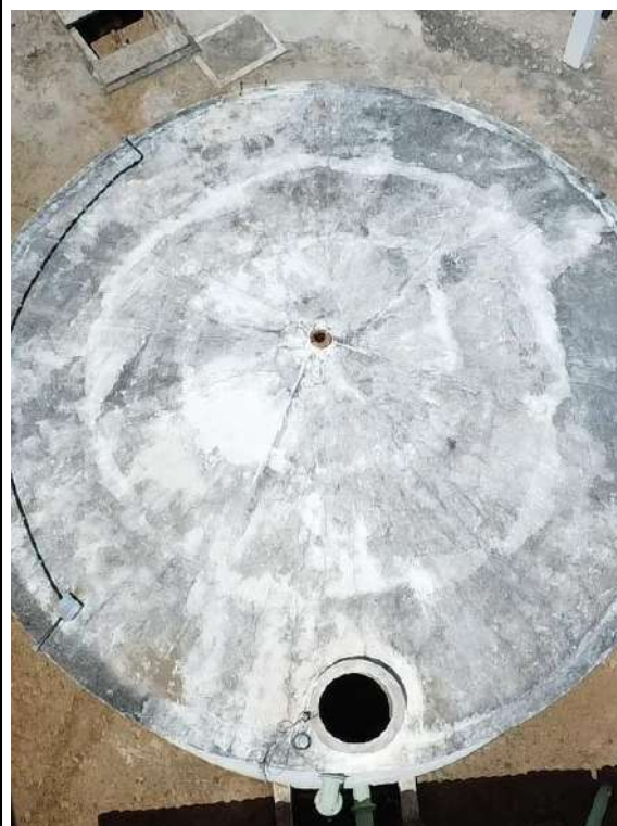
Foto 4 - RSE-01: ausência de tampa
