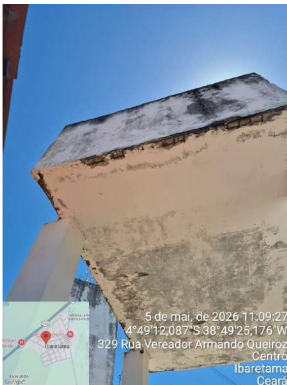
Foto 16 - REL-09: apresenta armaduras expostas nos pilares e ao redor do reservatório.
