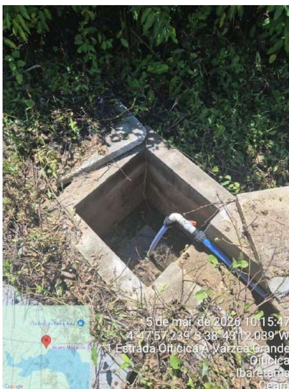
Foto 7 - Pátio da ETA: caixas com tampas quebradas ou deslocadas e com vegetação e acúmulo de água.
