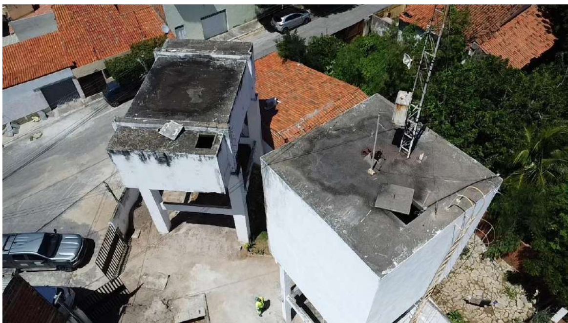
Foto 15 - REL-09 e REL-10: unidades encontram-se desativadas, tampas deslocadas.
