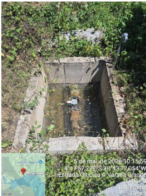
Foto 1 - Pátio da ETA: caixa do medidor da entrada sem tampa / grade de proteção.
