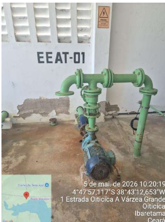
Foto 11 - EEAT-01: parede com reboco e pintura deteriorados.
