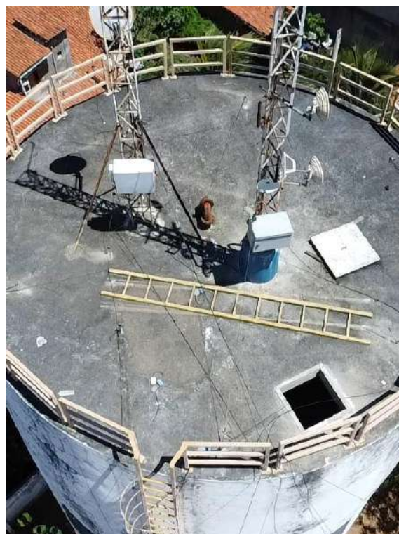
Foto 14 - REL-11: pintura desgastada e tampa deslocada.
