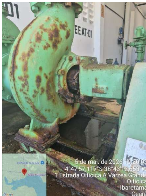
Foto 10 - EELF-01: bomba oxidada e com vazamento.
