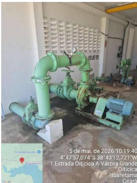
Foto 9 - EELF-01: vazamento na bomba e drenagem falha no piso no entorno da elevatória.
