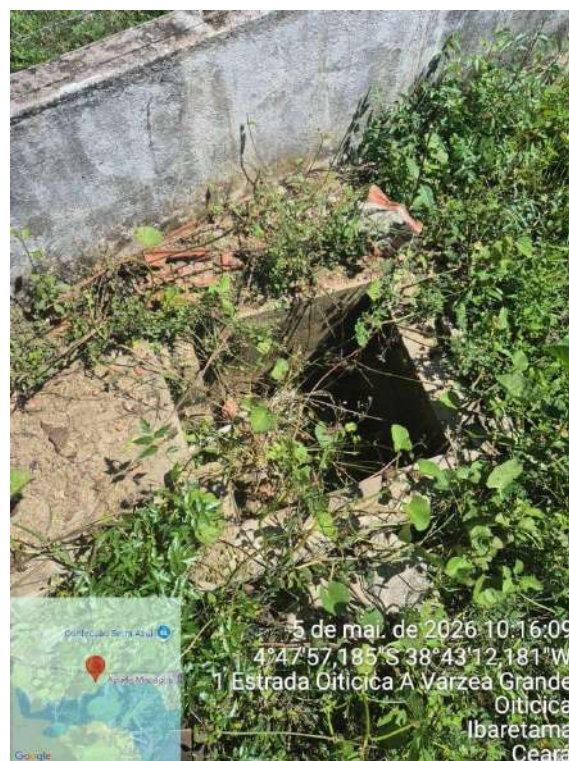
Foto 6 - Pátio da ETA: caixas com tampas quebradas ou deslocadas e com vegetação.
