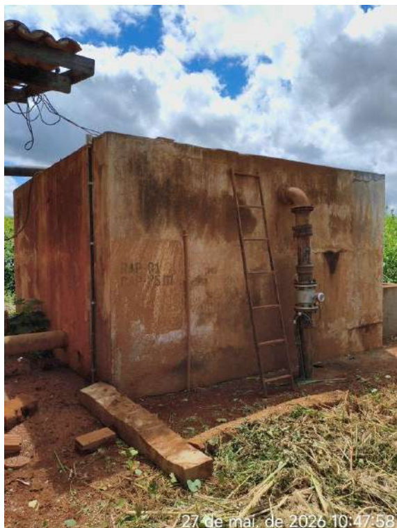
Foto 61 - RAP-01: pintura e identificação desgastadas; micro vazamentos.
