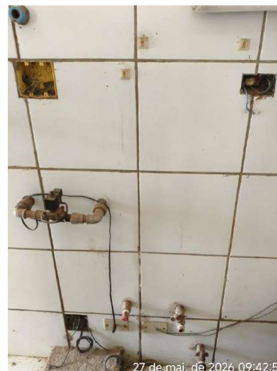
Foto 14 - ETA / Casa de Química / Laboratório: tomadas elétricas com fiação exposta e sem tampas.
