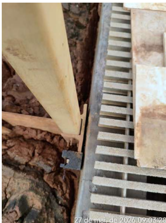
Foto 30 - ETA / Floco-decantador: fixação com parafusos frouxos.
