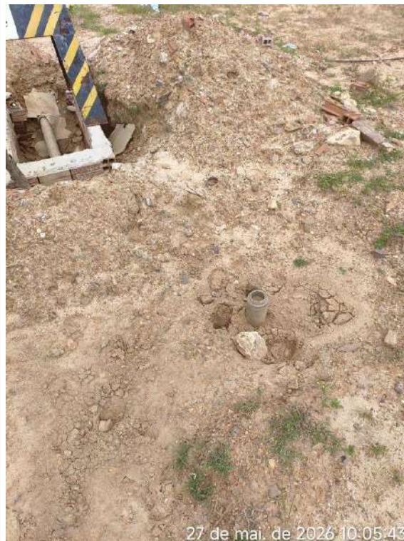
Foto 24 - RAP-03: registros de manobra desprovidos de caixa de proteção.
