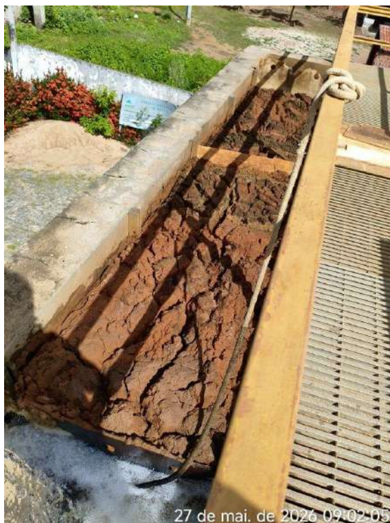
Foto 28 - ETA / Floco-decantador: floculação com formação e acúmulo de flocos.
