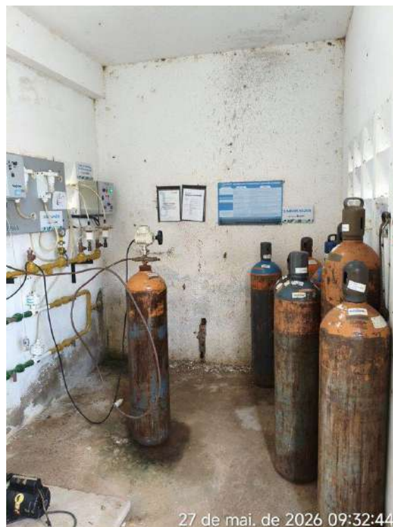
Foto 48 - ETA / Casa de Química / Laboratório: reboco e pintura deteriorados.
