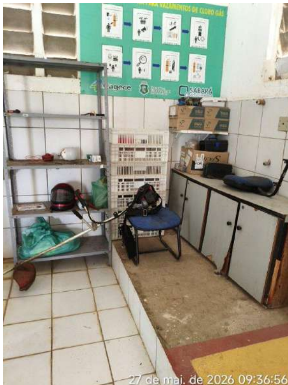
Foto 55 - ETA / Casa de Química / Laboratório: móvel de apoio dos técnicos em estado precário de conservação na casa de química.
