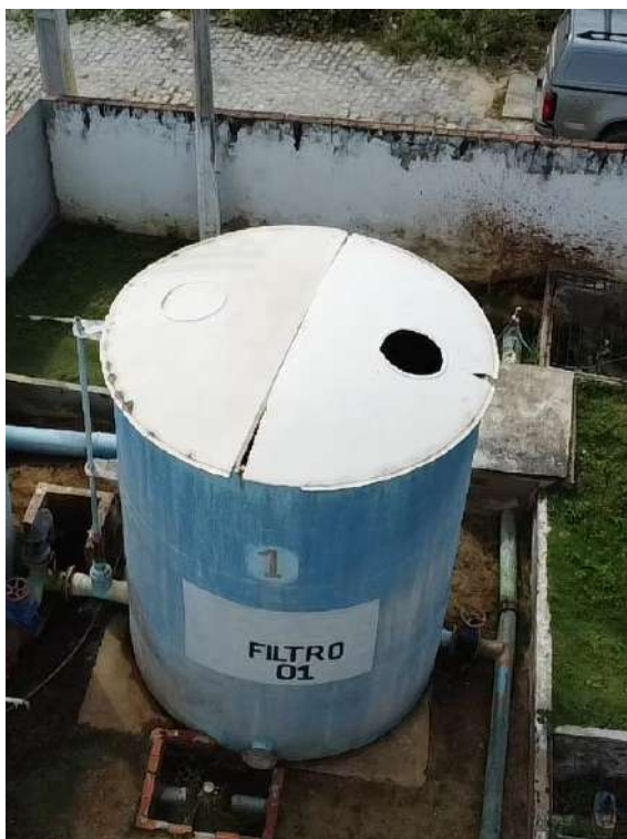
Foto 7 - ETA / Filtros: F-01 sem tampa.
