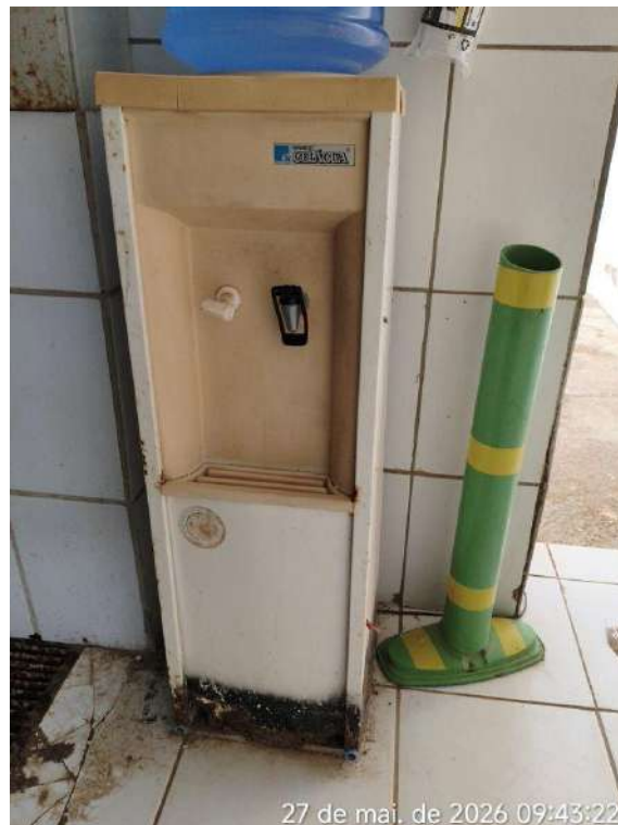
Foto 56 - ETA / Casa de Química / Laboratório: equipamento de água potável em processo avançado de corrosão/oxidação.
