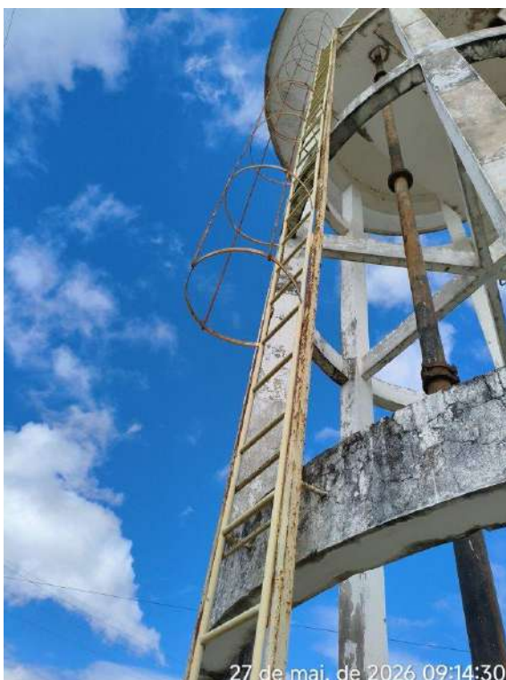
Foto 34 - ETA / REL-01: escada de acesso em processo de corrosão/oxidação.
