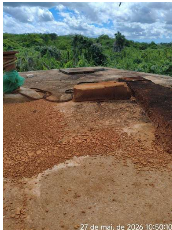
Foto 62 - RAP-01: tampa da entrada de inspeção corroída e sem vedação adequada.
