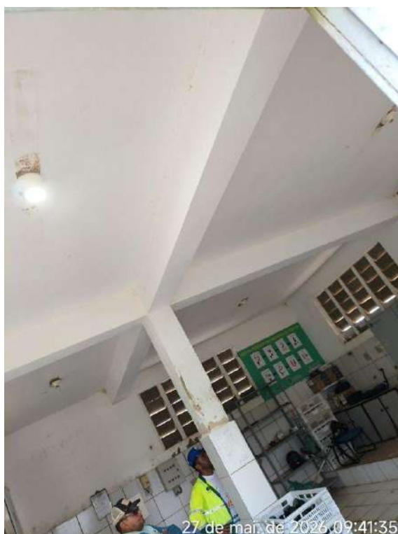
Foto 53 - ETA / Casa de Química / Laboratório: iluminação não funcional.
