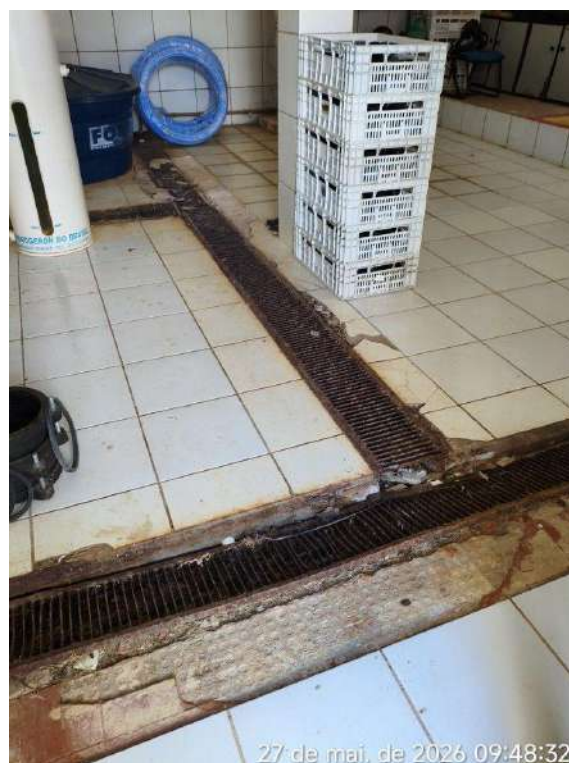
Foto 50 - ETA / Casa de Química / Laboratório: com piso danificado; calha de piso com grelha de proteção danificada.
