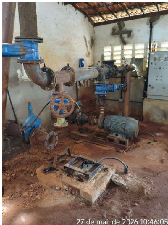
Foto 63 - EEAB-02: pintura, reboco e piso deteriorados.
