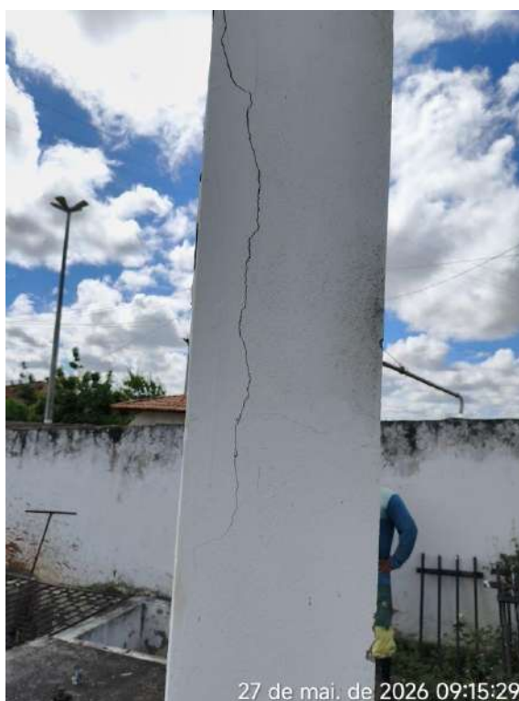
Foto 37 - ETA / REL-01: rachaduras nas bases das colunas.
