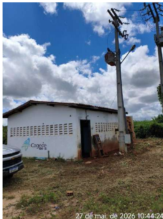
Foto 60 - EEAB-02: pintura deteriorada.
