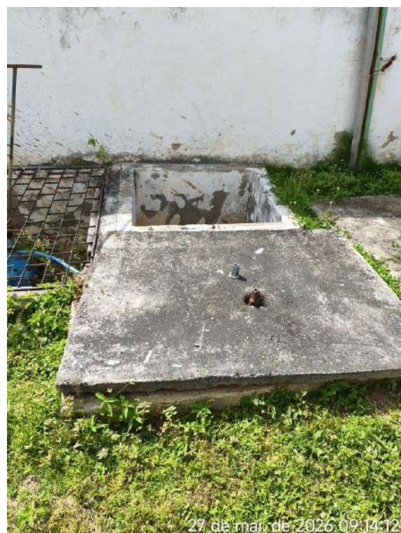
Foto 2 - ETA / Pátio: caixa desprovida de tampa ou grade de proteção.
