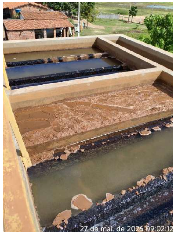
Foto 29 - ETA / Floco-decantador: decantador com carreamento de flocos.
