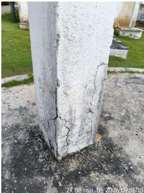
Foto 39 - ETA / REL-01: rachaduras nas bases das colunas.
