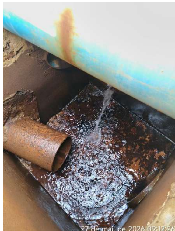
Foto 33 - ETA / Filtros: vazamento tubulação dos filtros.
