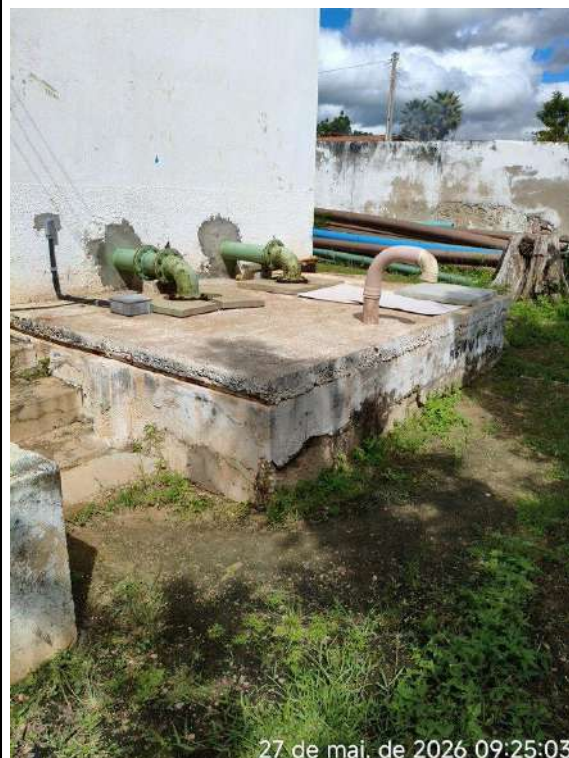
Foto 8 - ETA / REN-01: abertura de inspeção desprovida de fechamento hermético e fios/cabos sem isolamento de proteção.
