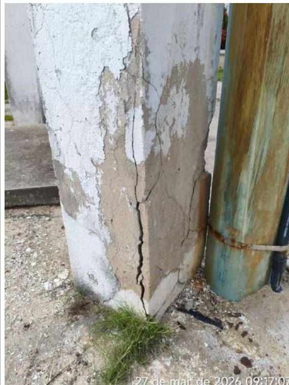
Foto 40 - ETA / REL-01: rachaduras nas bases das colunas.
