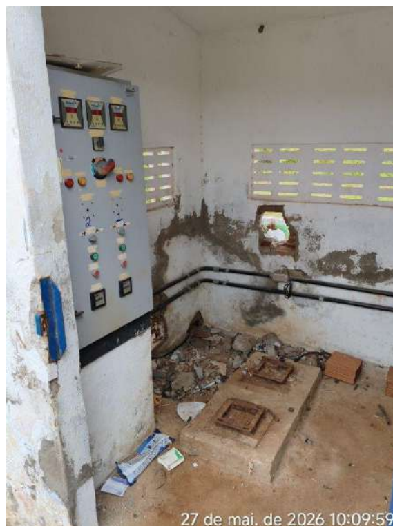
Foto 58 - RAP-03 / EERD-01: parede e pintura deterioradas; sujeidade e entulho na casa do quadro de comando.
