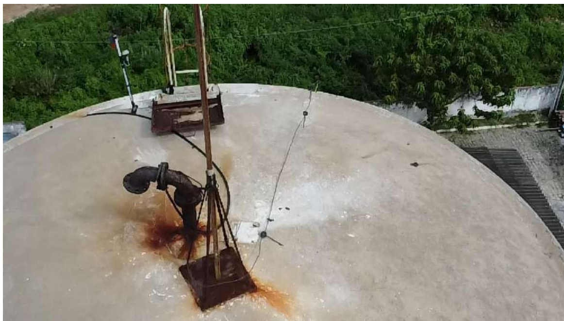
Foto 36 - ETA / REL-01: tampa da abertura de inspeção aberta e corroída; base e para-raios corroídos.
