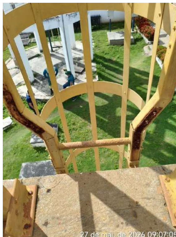
Foto 31 - ETA / Floco-decantador: fixações em processo de corrosão.
