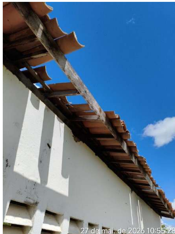
Foto 64 - EEAB-02: telhado deteriorado.
