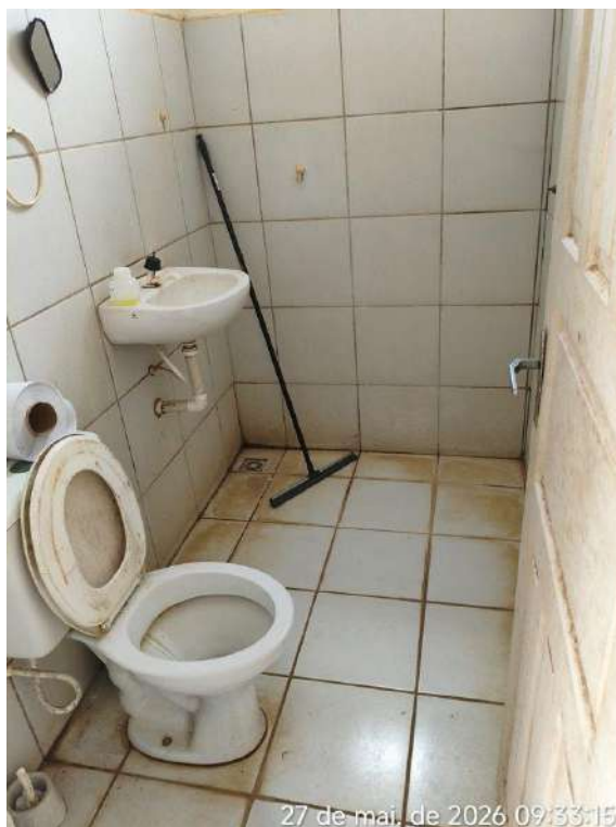
Foto 51 - ETA / Casa de Química / Laboratório: banheiro com sujeidades.
