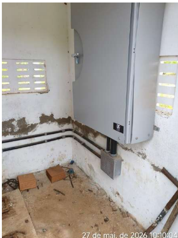
Foto 59 - RAP-03 / EERD-01: parede e pintura deterioradas; sujeira e entulho na casa do quadro de comando.
