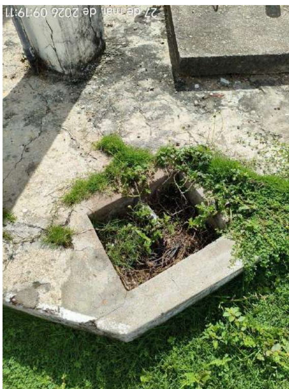
Foto 1 - ETA / Pátio: caixa desprovida de tampa ou grade de proteção.
