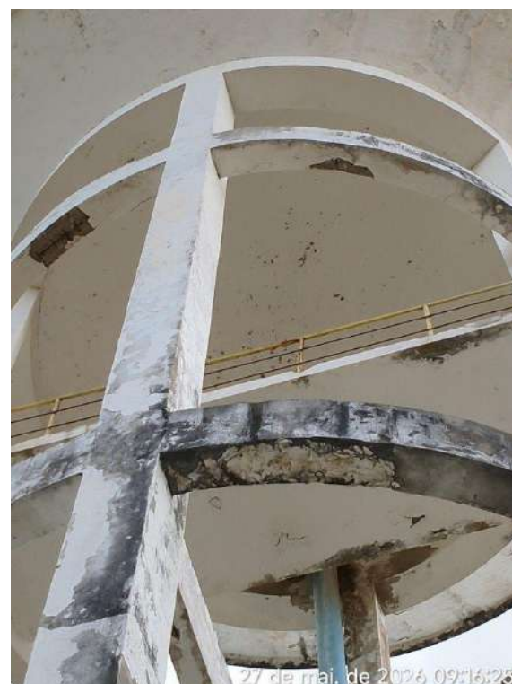
Foto 41 - ETA / REL-01: armaduras expostas nas vigas.
