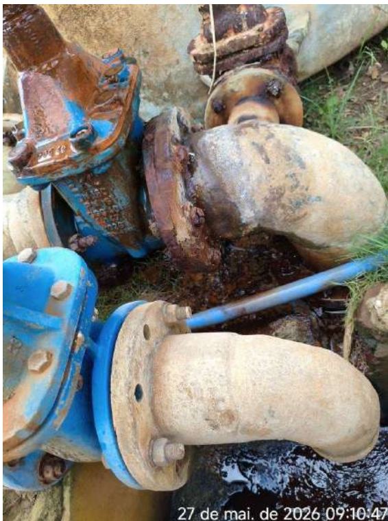
Foto 32 - ETA / Filtros: registro corroído e com vazamento.
