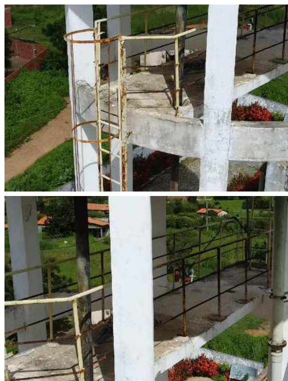
Foto 35 - ETA / REL-01: escada de acesso e guarda-corpo / grade de proteção em processo de corrosão/oxidação.
