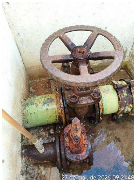
Foto 44 - ETA / RAP-02: vazamento em registro.
