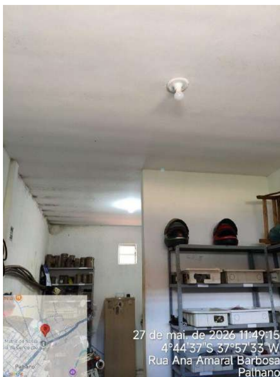
Foto 65 - Escritório / Almoxarifado: lâmpada queimada, comprometendo a iluminação do ambiente.
