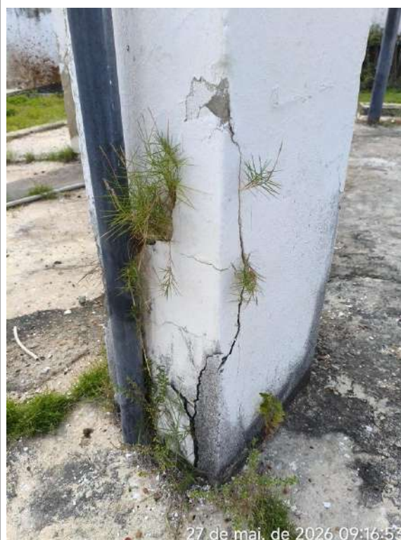
Foto 38 - ETA / REL-01: rachaduras nas bases das colunas.
