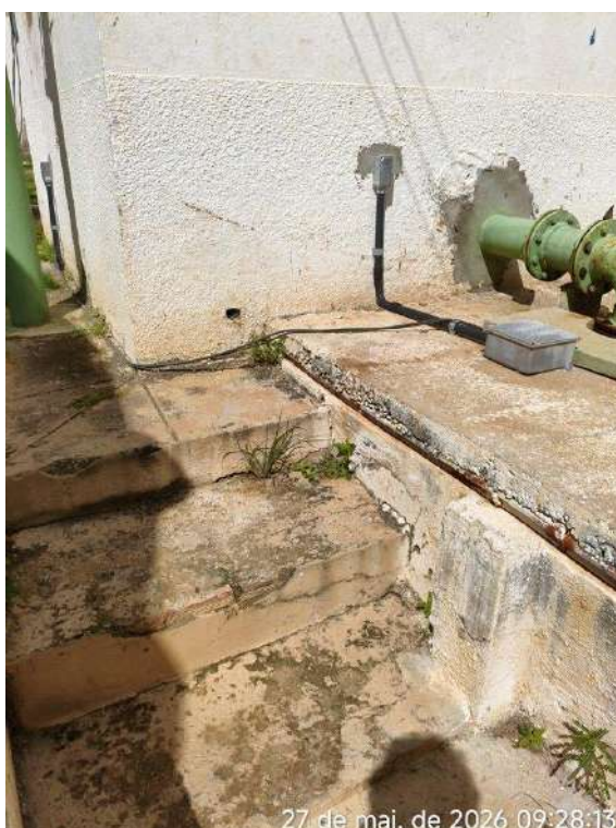
Foto 9 - ETA / REN-01: fios/cabos sem isolamento de proteção.
