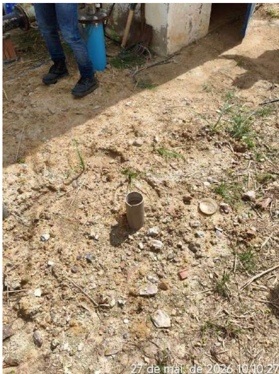
Foto 23 - RAP-03: registros de manobra desprovidos de caixa de proteção.
