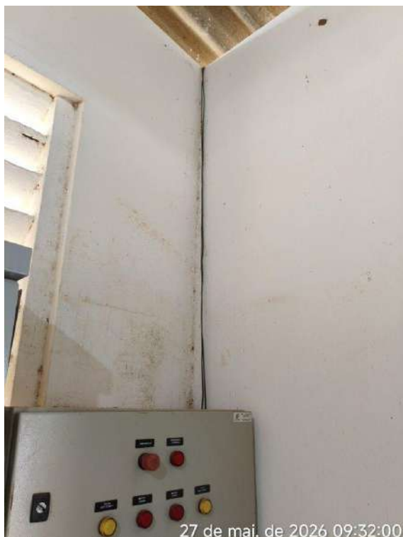
Foto 11 - ETA / EEAT-01: fiação inadequada sem eletrodutos de proteção e isolamento.
