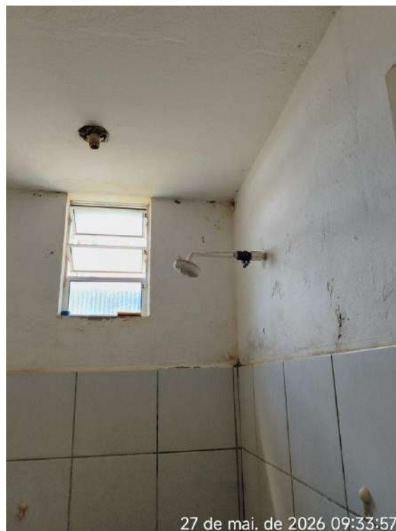
Foto 52 - ETA / Casa de Química / Laboratório: banheiro com lâmpada queimada.
