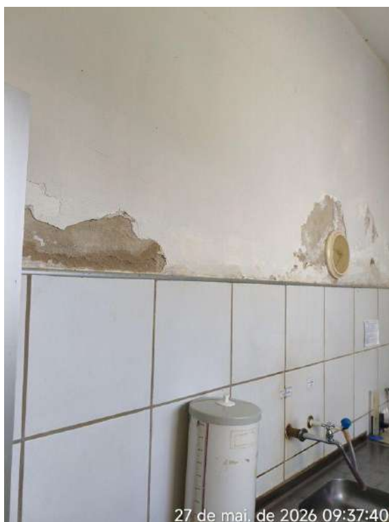
Foto 49 - ETA / Casa de Química / Laboratório: reboco e pintura deteriorados.
