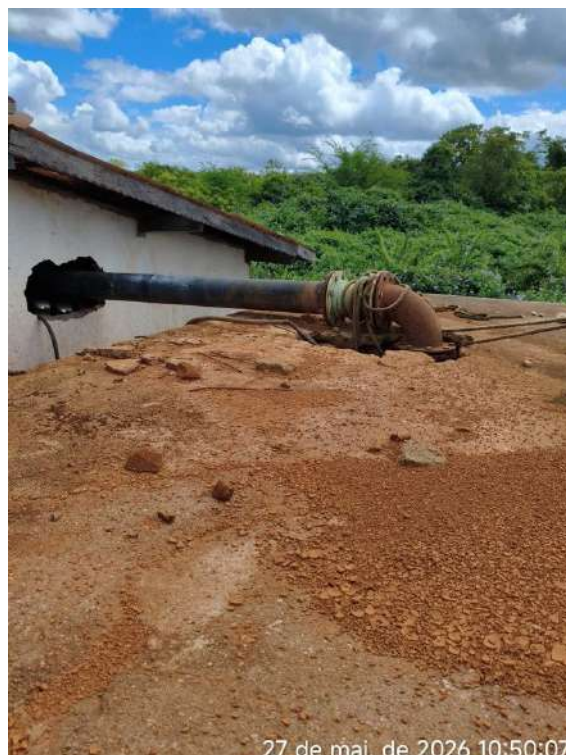
Foto 20 - ETA / REL-01: furo na laje de cobertura sem acabamento.
