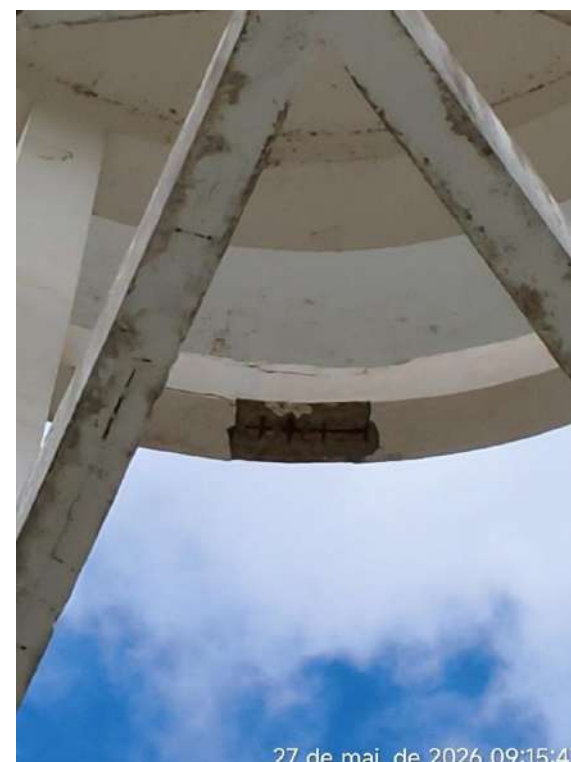
Foto 42 - ETA / REL-01: armaduras expostas nas vigas.
