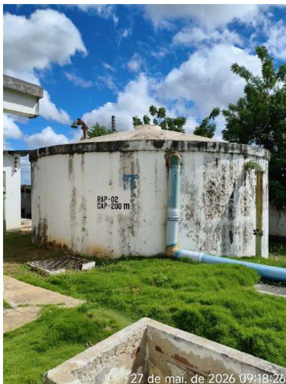
Foto 43 - ETA / RAP-02: pintura deteriorada.
