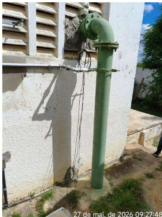
Foto 12 - ETA / EEAT-01: fiação inadequada, instalada através de cobogó, sem eletrodutos de proteção e isolamento.
