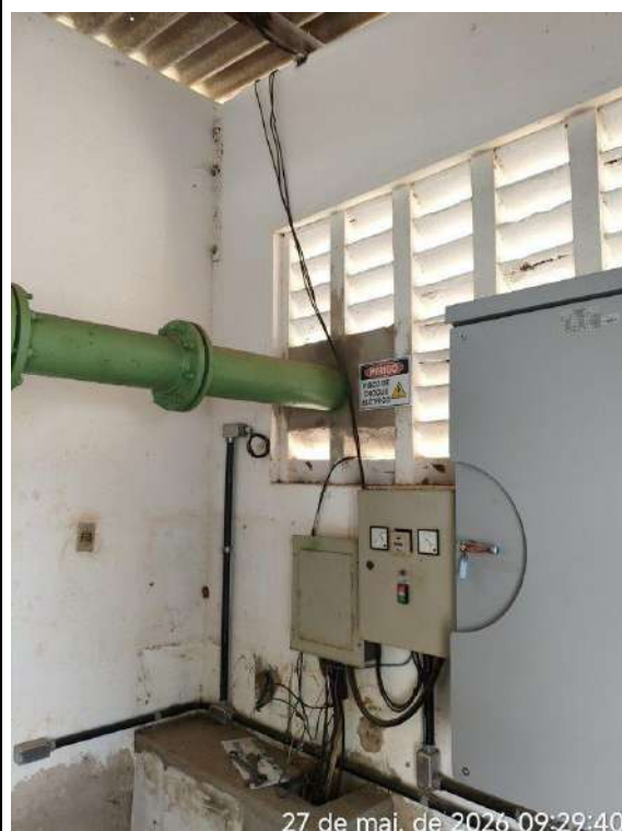
Foto 10 - ETA / EEAT-01: fiação inadequada, instalada através de cobogó, sem eletrodutos de proteção e isolamento.
