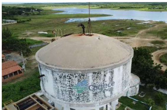
Foto 19 - ETA / REL-01: cabeamento elétrico preso à estrutura metálica da escada; ausência de guarda-corpo / grade de proteção.
