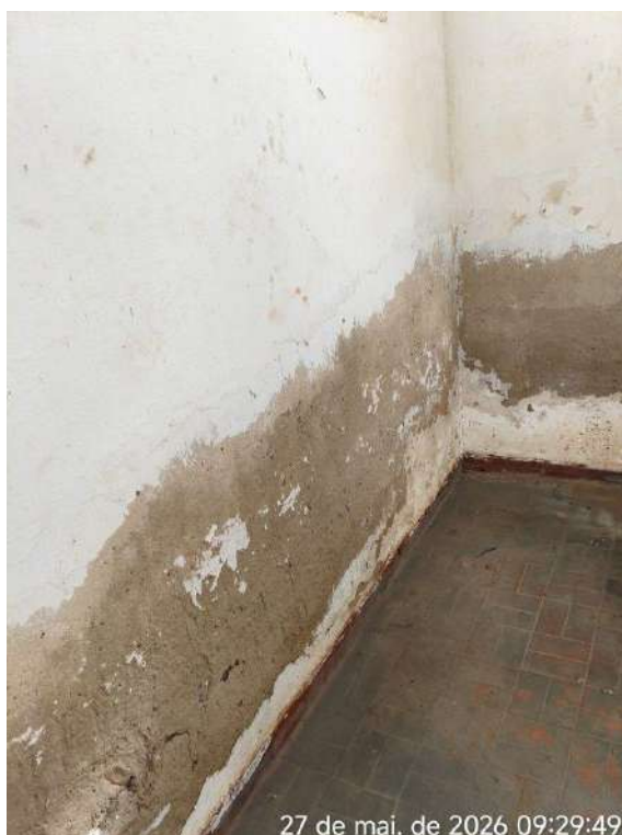
Foto 45 - ETA / EEAT-01: reboco e pintura deteriorados.
