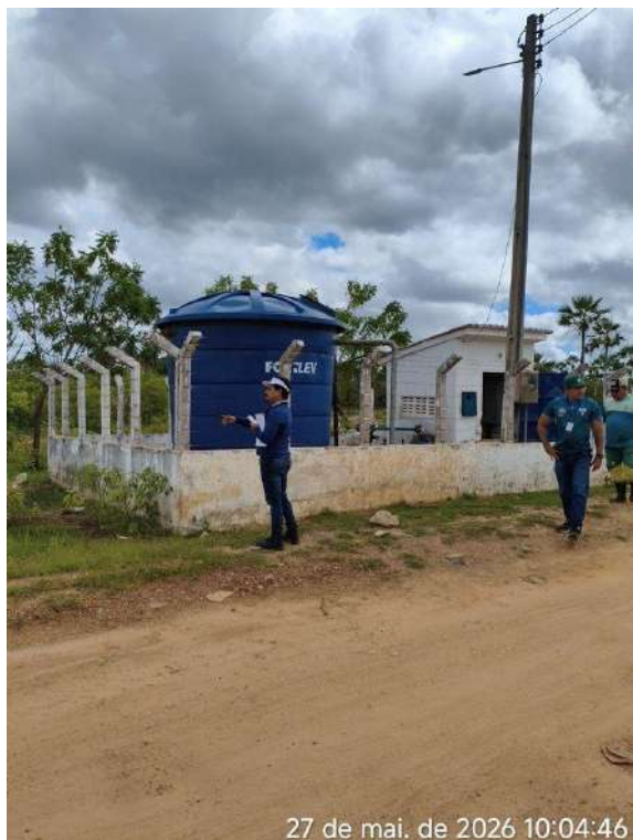
Foto 22 - RAP-03: ausência de identificação e pintura deteriorada.
