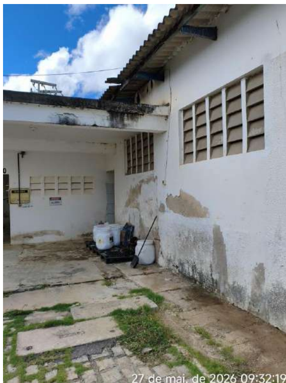
Foto 47 - ETA / Casa de Química / Laboratório: reboco e pintura deteriorados.
