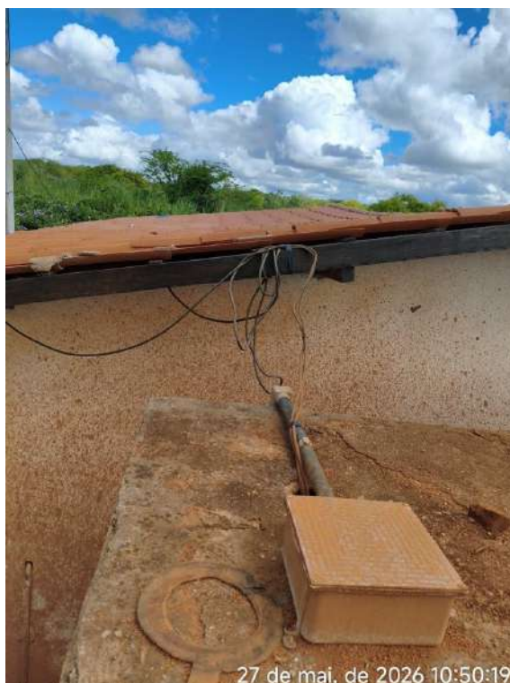
Foto 21 - ETA / REL-01: cabeamento elétrico sem eletroduto de proteção e isolamento.
