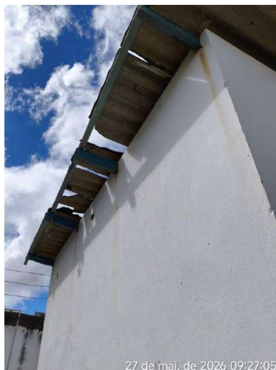
Foto 46 - ETA / EEAT-01: telhado danificado.
