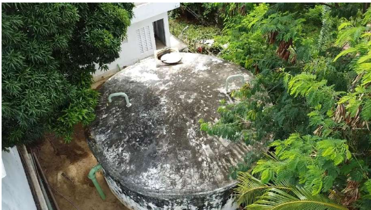
Foto 32 - RAP-04: pintura desgastada, rachaduras na laje e nas laterais.
