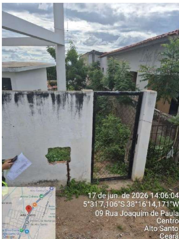
Foto 37 - REL-01: muro danificado.
