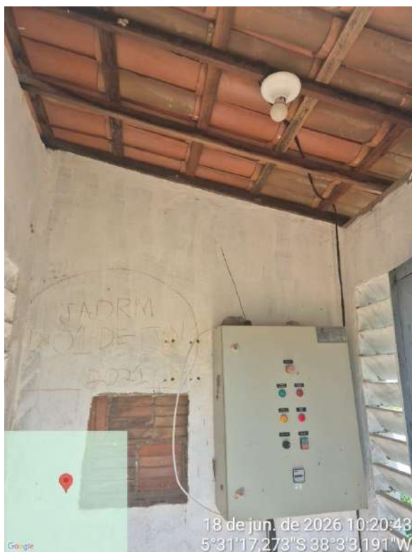
Foto 19 - PT-19: tomada da luz danificada.
