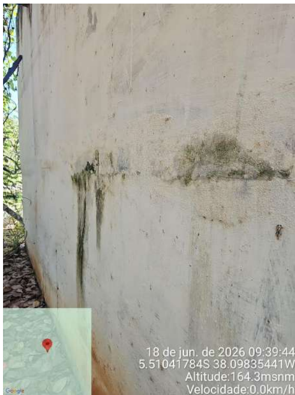
Foto 35 - RAP-05: sinais de infiltração e sem identificação
