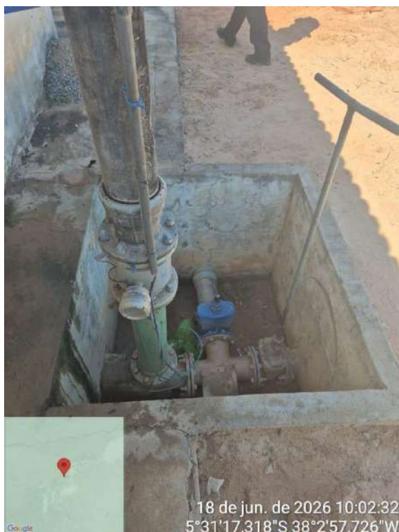
Foto 5 - EEAT-04: caixas sem grade de proteção.
