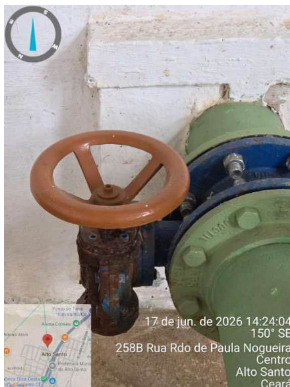
Foto 30 - ETA / Casa de bombas: registro de saída oxidado.
