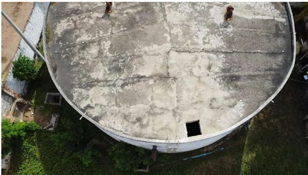
Foto 7 - RAP-03: ausência de tampa e oxidação nos suspiros.
