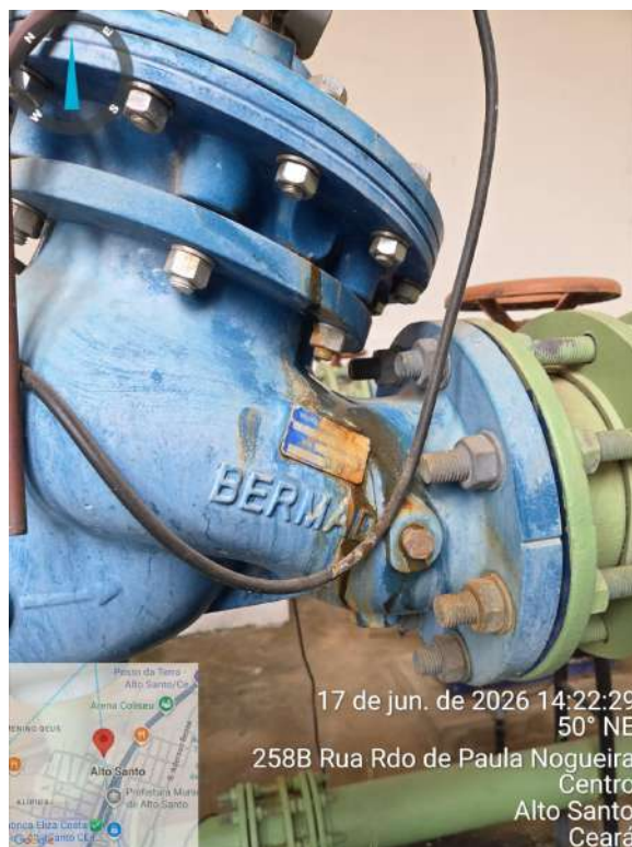
Foto 28 - ETA / Casa de bombas: vazamento na válvula da bomba.
