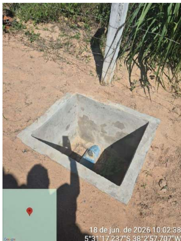
Foto 6 - EEAT-04: caixas sem grade de proteção.
