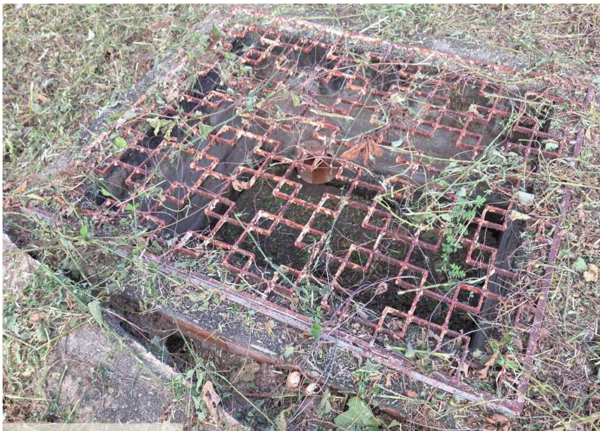
Foto 42 - REL-02: grade oxidada.
