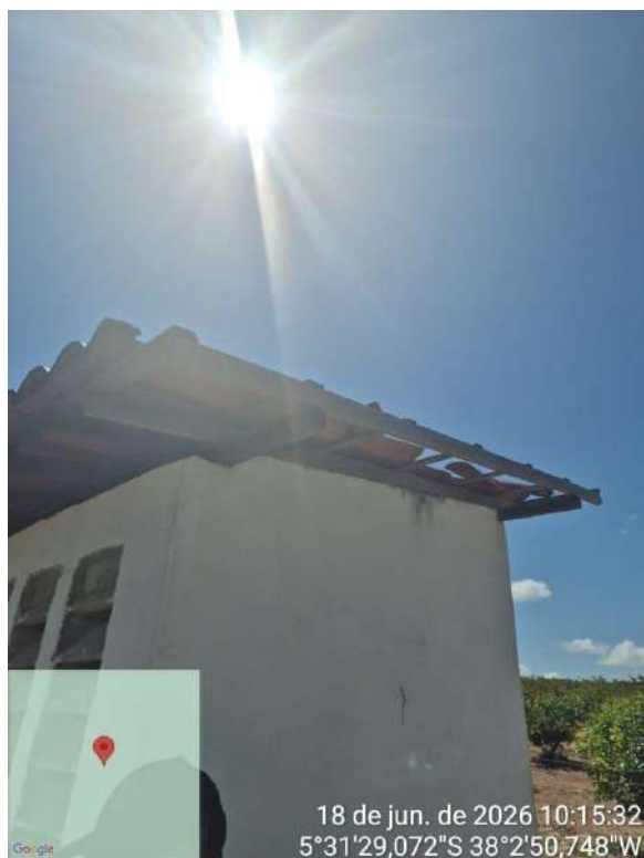
Foto 16 - PT-18: telhado danificado.
