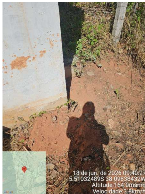
Foto 36 - RAP-05: cavidade feita por animais que pode prejudicar a fundação.
