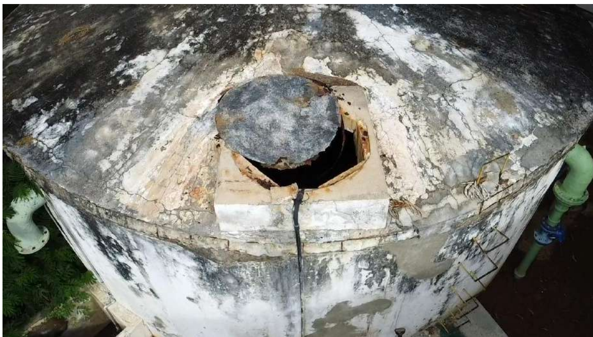
Foto 34 - RAP-04: escada oxidada e sem apoio adequado; tampa oxidada e deslocada, com risco de contaminação.
