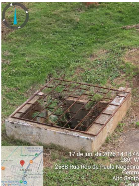
Foto 25 - ETA: caixa parcialmente quebrada e com grade oxidada.
