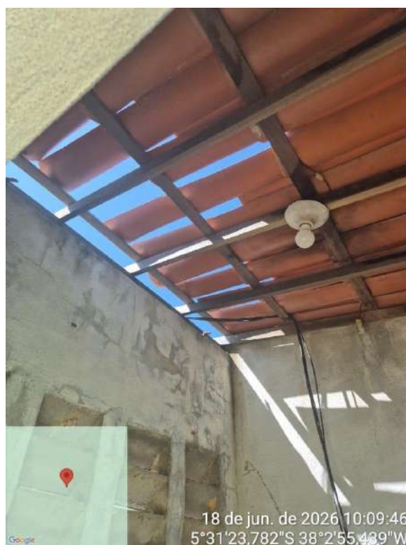
Foto 14 - PT-17: telhado danificado e a fiação disposta sem segurança e conduto adequado.
