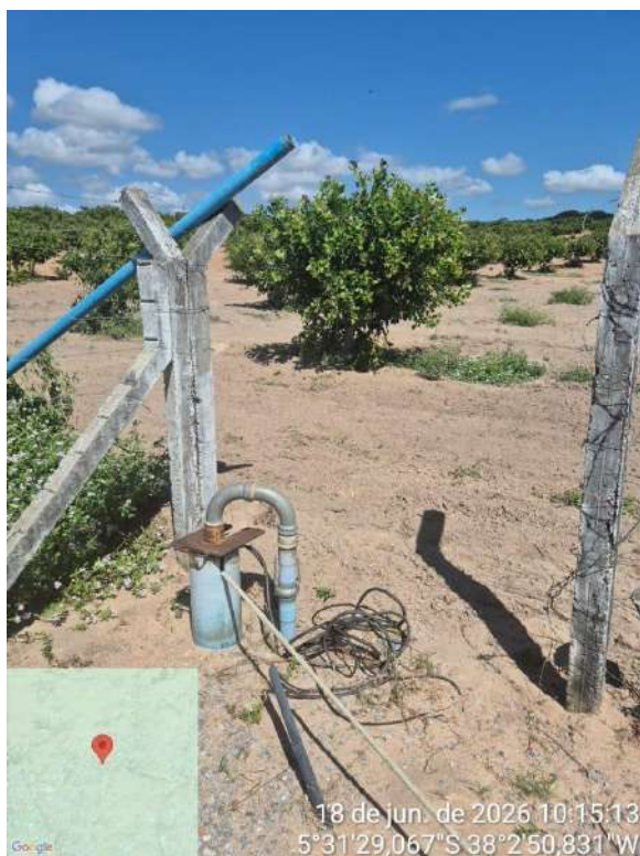
Foto 15 - PT-18: sem identificação, cerca danificada e fiação disposta inadequadamente.
