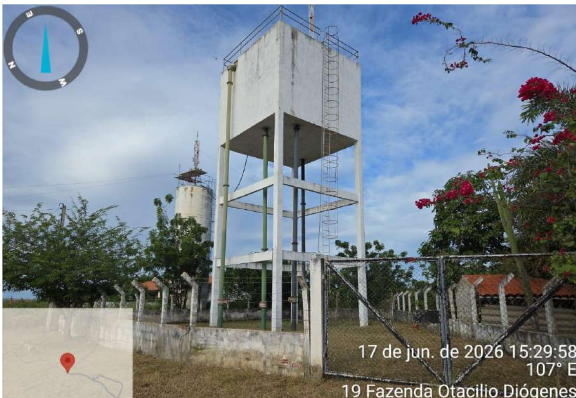
Foto 43 - REL-02: escada oxidada.
