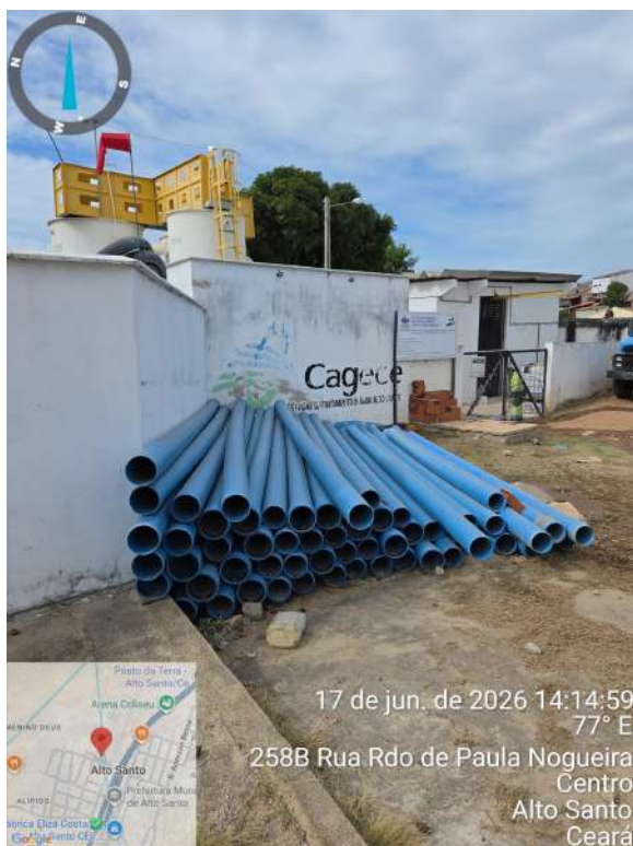
Foto 23 - ETA: tubulação armazenada inadequadamente.
