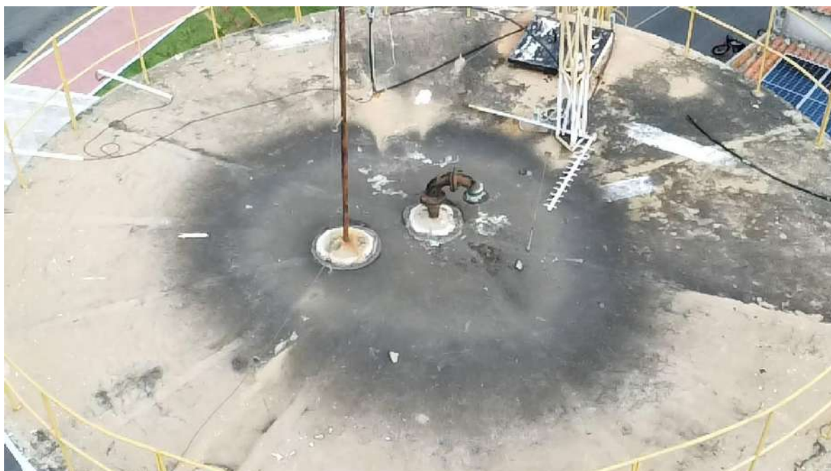
Foto 41 - REL-01: presença de sujeira na laje e peças oxidadas.
