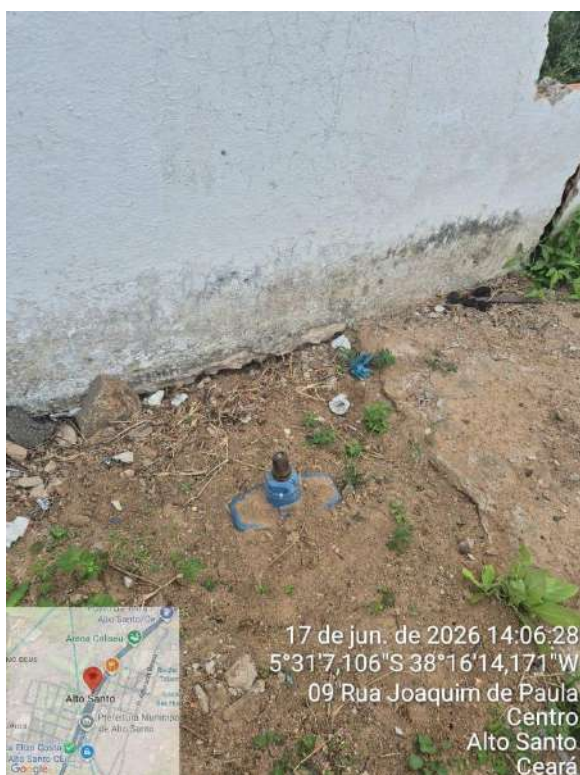
Foto 11 - REL-01: registro sem grade de proteção.
