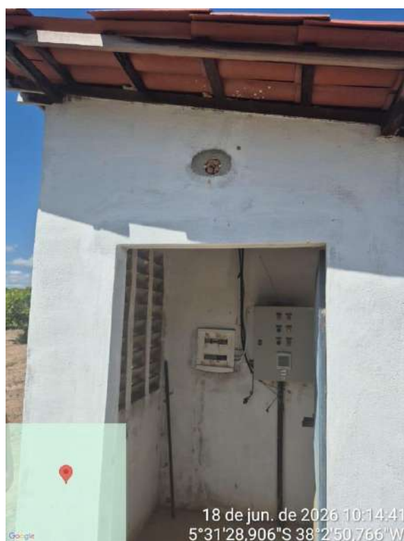
Foto 2 - PT-18: sem identificação e sem iluminação.
