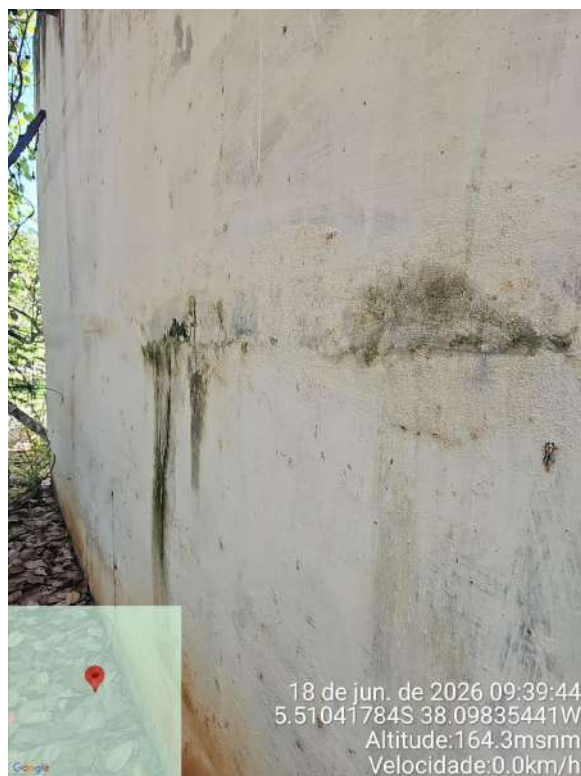
Foto 10- RAP-05: sem identificação.
