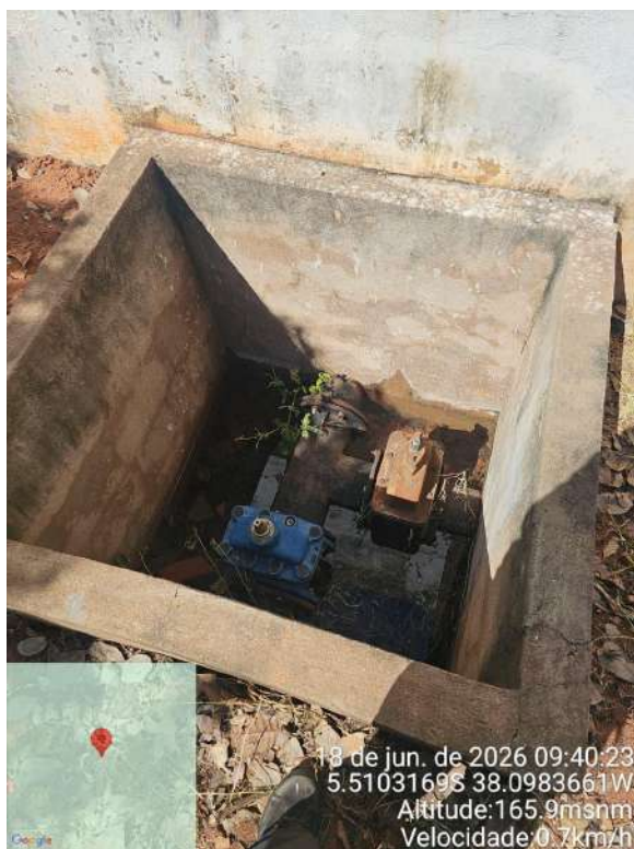
Foto 9 - RAP-05: caixa sem grade de proteção.
