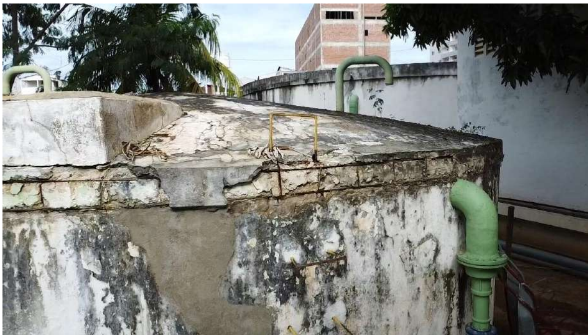
Foto 33 - RAP-04: rachaduras na laje e nas laterais, escada oxidada e sem apoio adequado.
