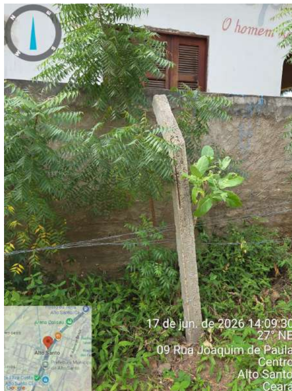
Foto 40 - REL-01: terreno sem fechamento adequado.
