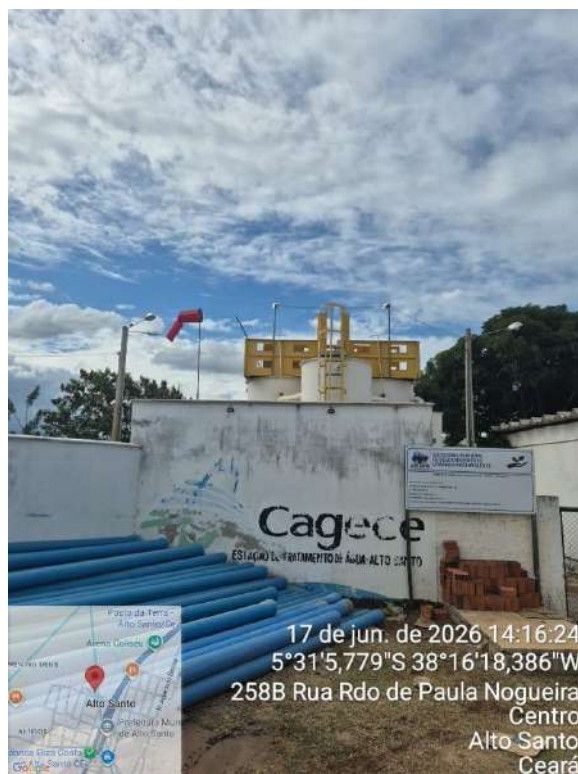
Foto 24 - ETA: pintura da identificação desgastada.
