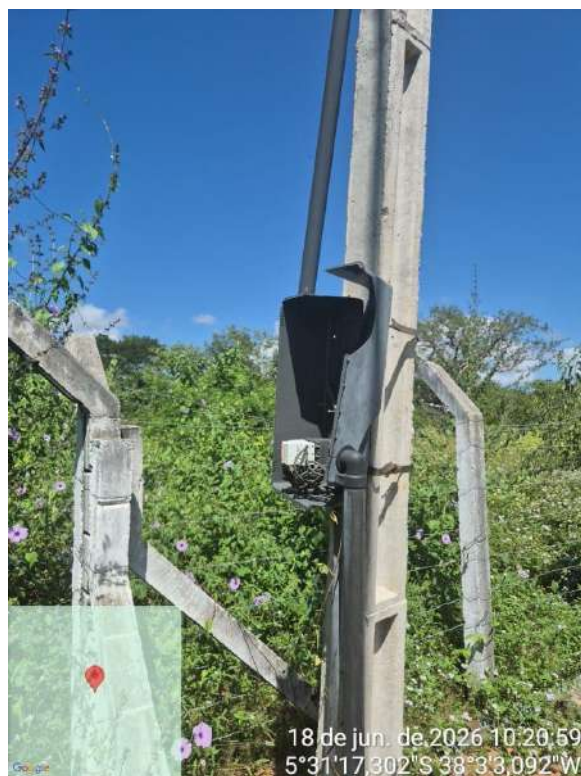
Foto 20 - PT-19: caixa de energia quebrada.
