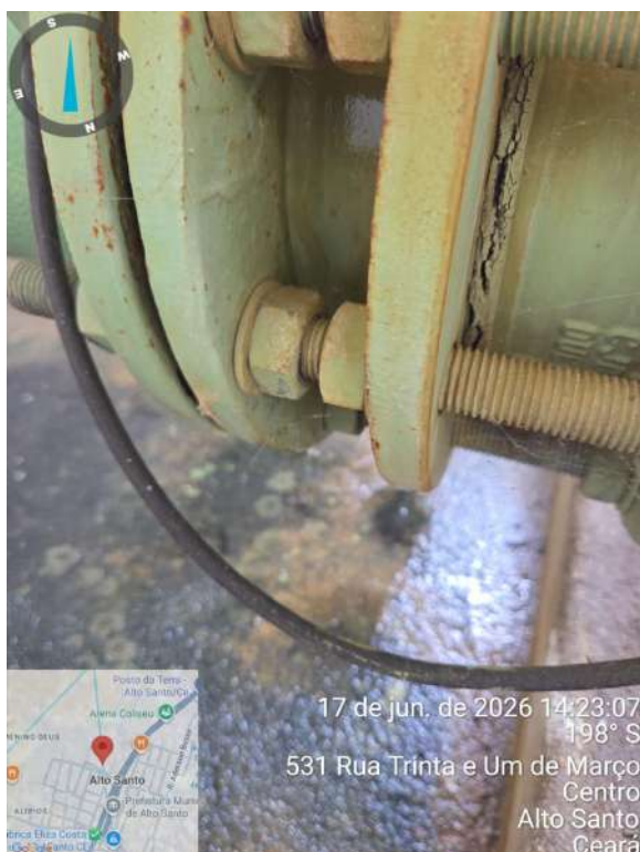
Foto 29 - ETA / Casa de bombas: vazamento na junta da saída da bomba.
