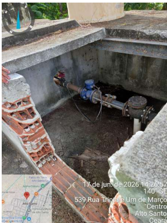
Foto 27 - ETA: caixa de proteção da EELF-02 danificada, parcialmente quebrada.
