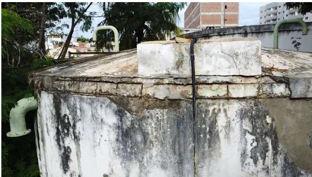
Foto 8 - RAP-04: armadura exposta e tampa quebrada.
