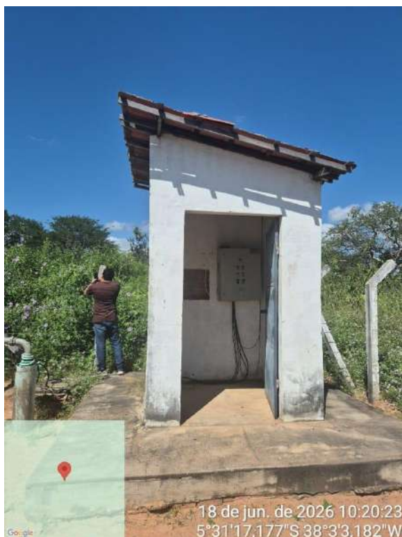
Foto 3 - PT-19: sem identificação e sem iluminação.
