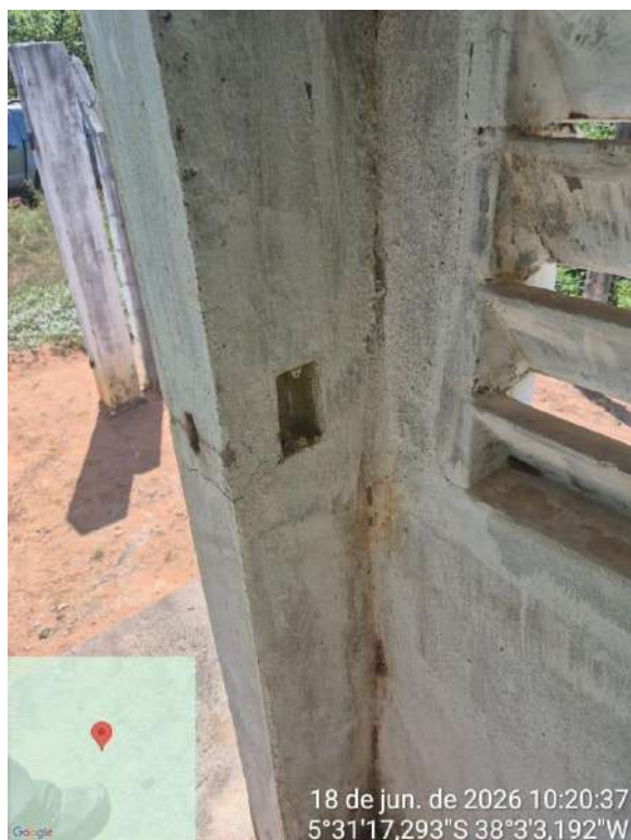
Foto 18 - PT-19: tomada da luz danificada.
