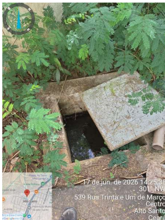
Foto 26 - ETA: caixa com tampa deslocada.
