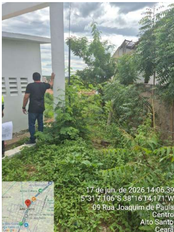
Foto 39 - REL-01: excesso de vegetação.
