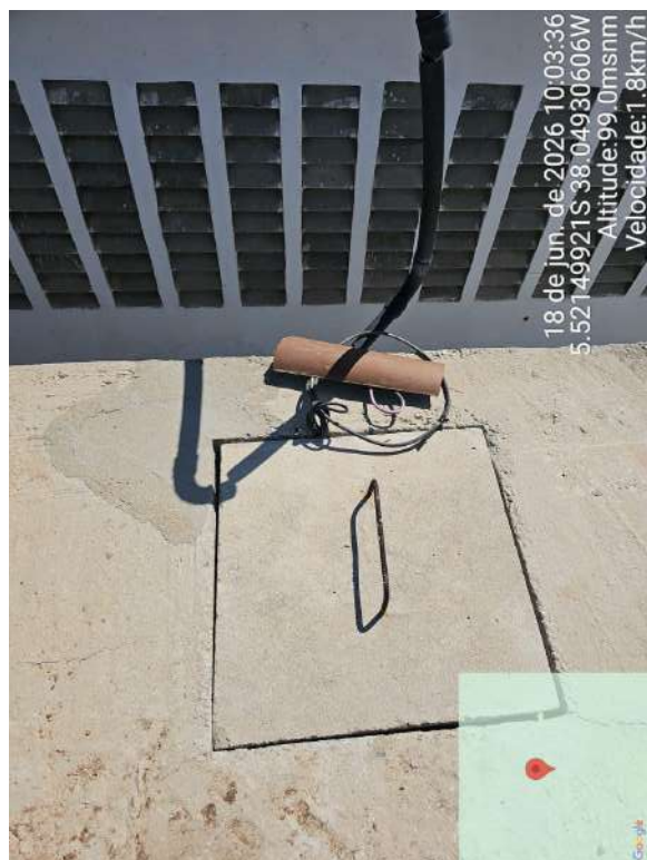
Foto 22 - RSE-01: fiação com apoio inadequado e sem proteção completa.
