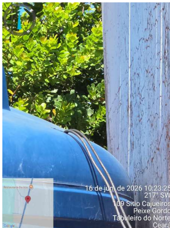
Foto 17 - RSE-01: abertura inadequada e passagem de fiação sem eletrodutos.
