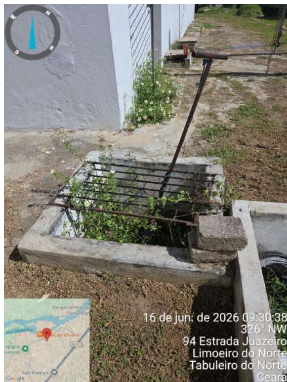
Foto 6 - ETA Tabuleiro: caixas sem tampa/grade de proteção.
