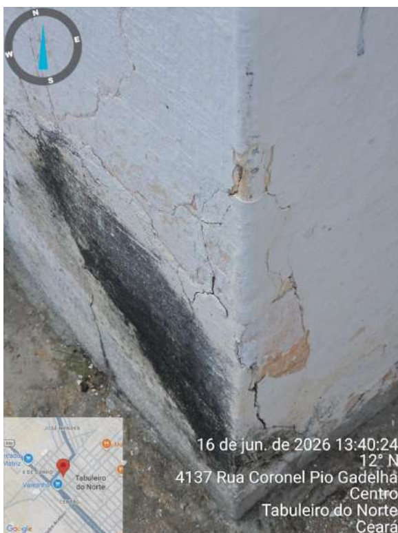
Foto 43 - RSE-01: presença de rachaduras.
