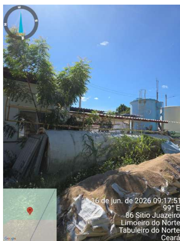
Foto 22 - ETA Tabuleiro do Norte: disposição inadequada de material de descarte.
