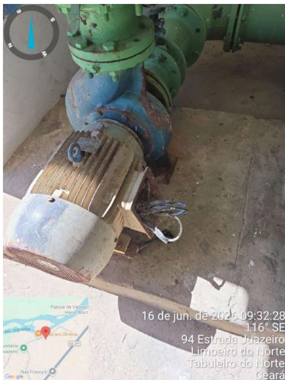
Foto 7 - ETA Tabuleiro: fiação da bomba sem proteção.
