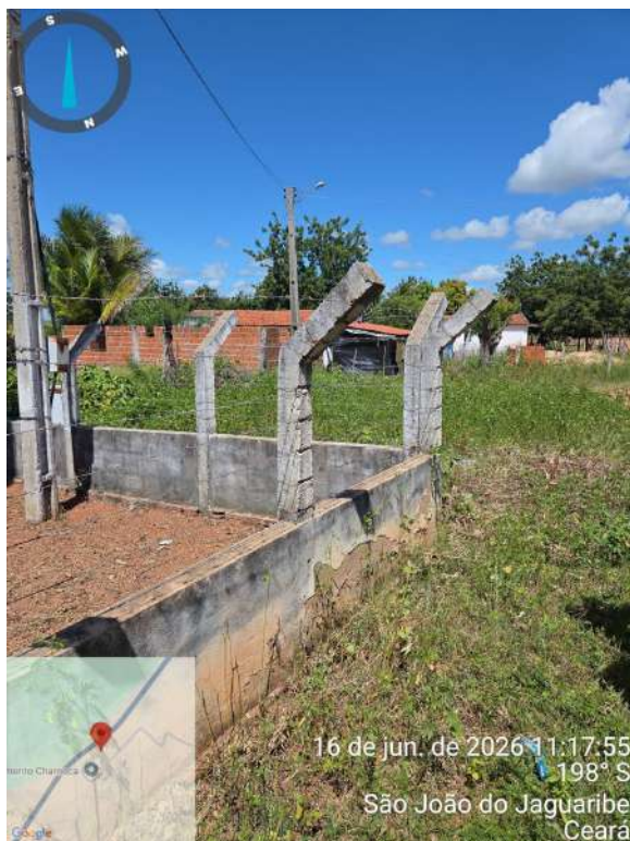
Foto 37 - REL-04: muro com parede desgastada.
