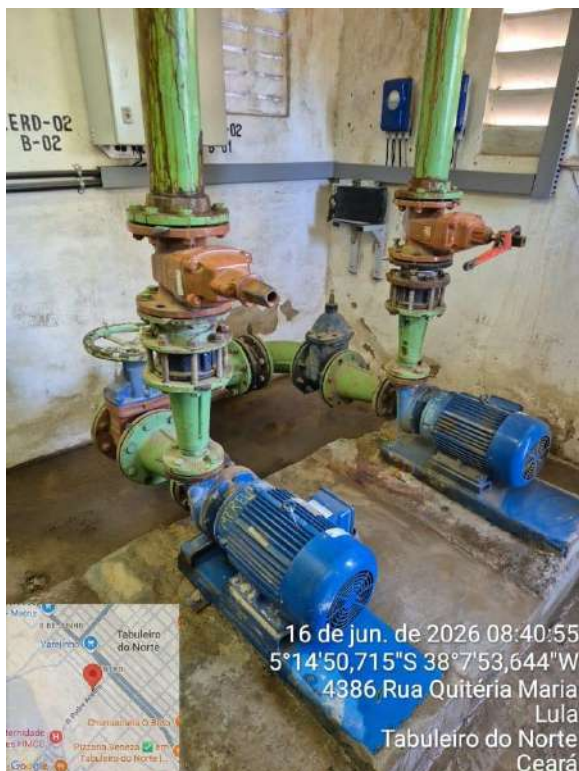
Foto 35 - EERD-02: bombas e piso com sujeira.
