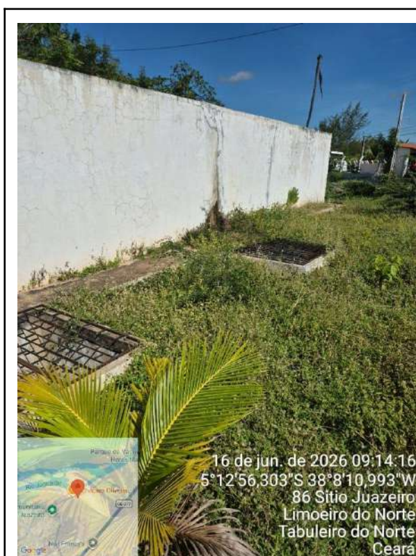
Foto 21 - ETA Tabuleiro do Norte: área sem limpeza.
