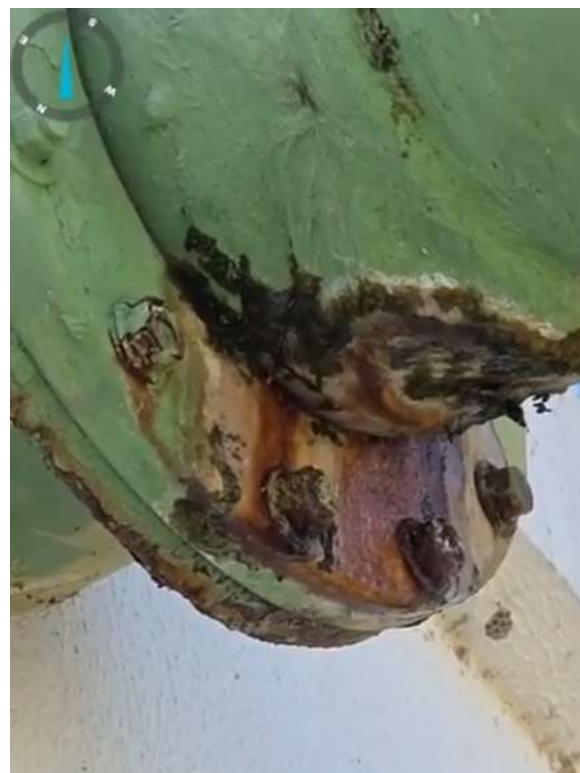
Foto 30 - ETA Tabuleiro do Norte: RAP-01 com tubulação oxidada e vazamento na junção.
