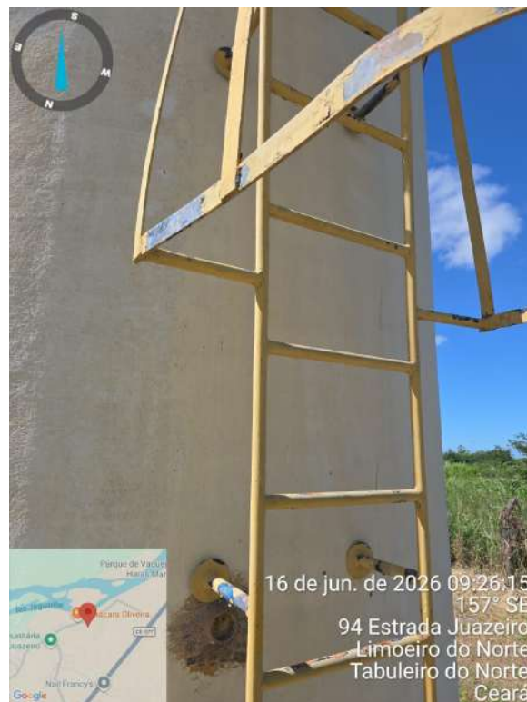
Foto 28 - ETA Tabuleiro do Norte: F-04 com escada sem fixação intermediária.
