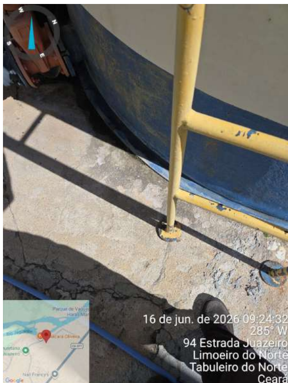
Foto 23 - ETA Tabuleiro do Norte: F-01 com escada sem fixação adequada
