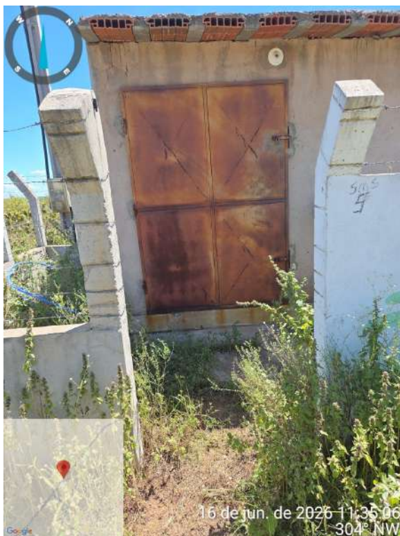
Foto 16 - RAP-05: sem identificação, pintura e portão de acesso, sem limpeza da área.
