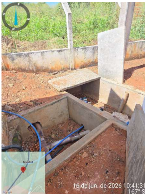
Foto 12 - EERD-07/09: caixas sem tampa/grade de proteção.
