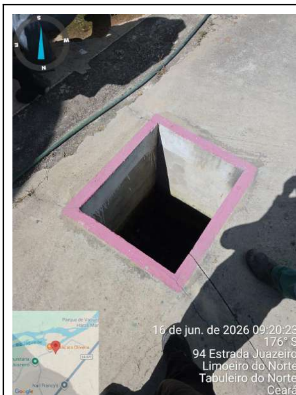
Foto 1 - ETA Tabuleiro: caixas sem tampa/grade de proteção.
