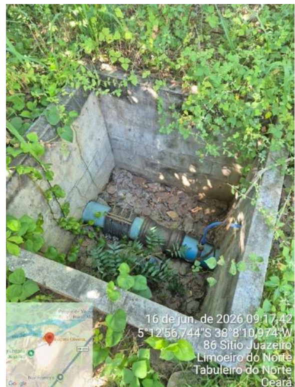
Foto 2 - ETA Tabuleiro: caixas sem tampa/grade de proteção.
