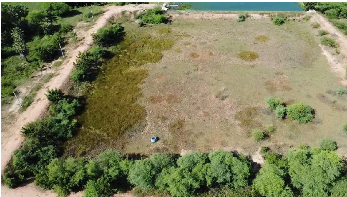
Foto 48 - ETE Tabuleiro do Norte: lagoa totalmente assoreada, reduzindo drasticamente o tempo de detenção hidráulica e a eficiência do processo biológico de degradação da matéria orgânica.
