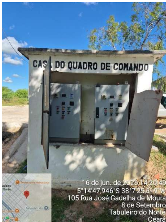
Foto 45 - ETE Tabuleiro do Norte: casa do quadro de comando com porta quebrada.
