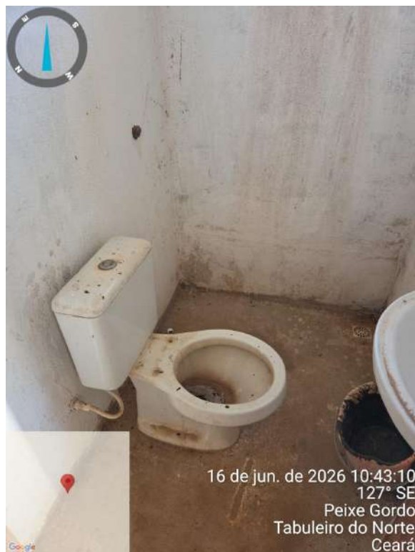
Foto 13 - EERD-07/09: banheiro inoperante, sem iluminação e tubulação de água.
