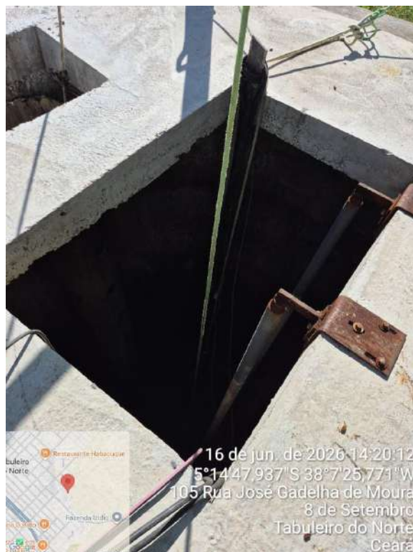
Foto 46 - ETE Tabuleiro do Norte: escada oxidada.
