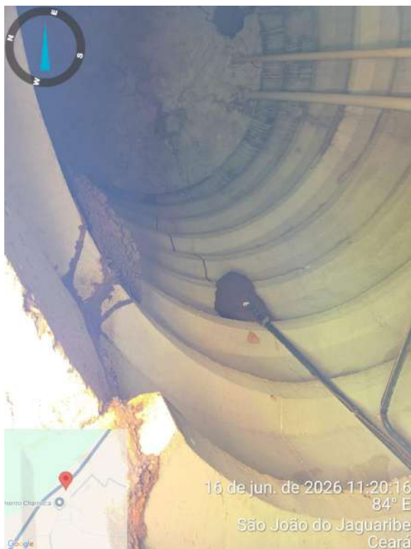
Foto 39 - REL-04: presença de cupim no interior da base do reservatório.
