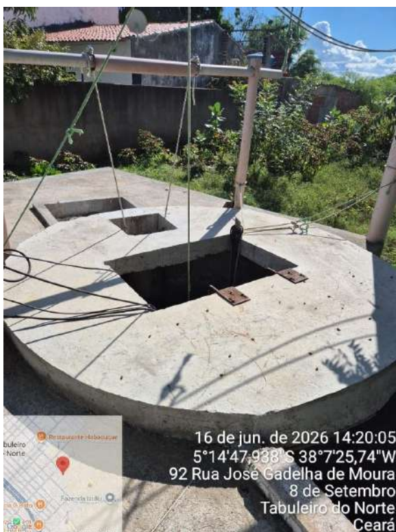
Foto 19 - ETE Tabuleiro do Norte: caixas sem tampa, fiação sem eletrodutos.
