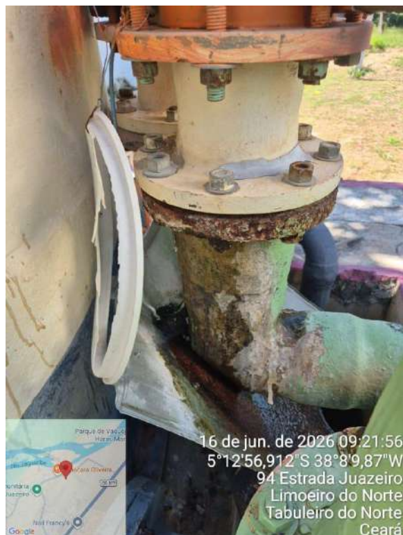
Foto 24 - ETA Tabuleiro do Norte: F-01 com vazamento e oxidação na tubulação.
