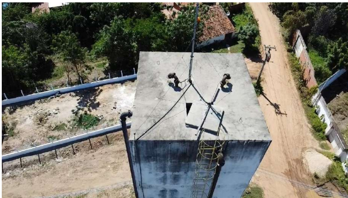
Foto 41 - REL-05: tampa deslocada e pintura desgastada.
