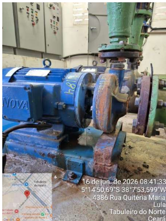
Foto 36 - EERD-02: bomba com junção e base oxidadas.
