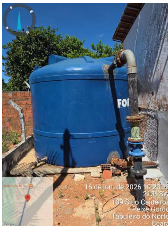
Foto 44 - RSE-03: tubulações com oxidação elevada, EERD-05 com pintura desgastada.
