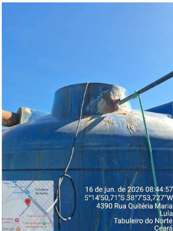
Foto 10 - EERD-02: fiação sem eletrodutos, RAP-03 sem tampa.
