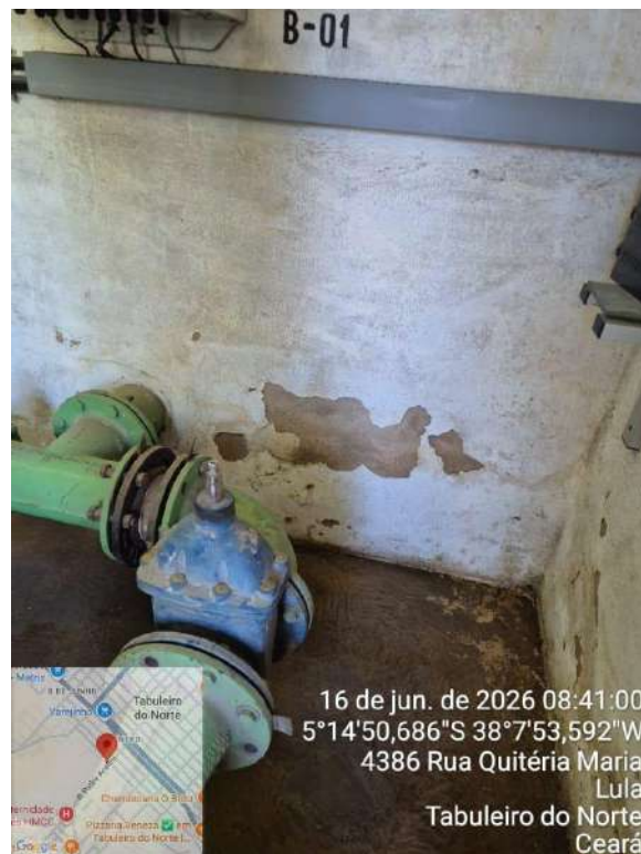
Foto 32 - EERD-02: revestimento desgastado.
