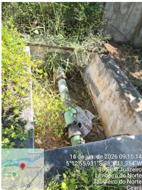
Foto 3 - ETA Tabuleiro: caixas sem tampa/grade de proteção.
