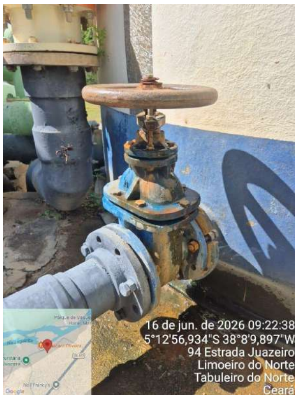
Foto 27 - ETA Tabuleiro do Norte: F-04 com vazamento na válvula.
