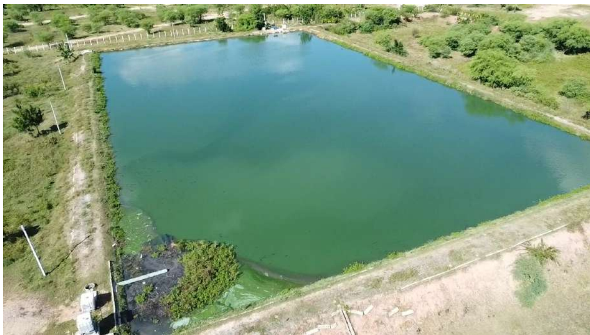
Foto 47 - ETE Tabuleiro do Norte: lagoa subdimensionada para o tratamento adequado da carga orgânica afluyente, com presença de vegetação.
