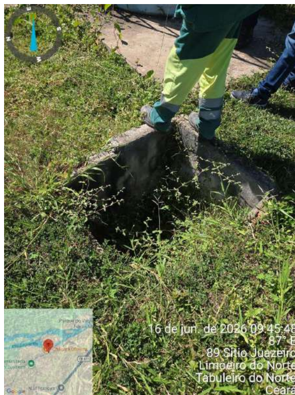
Foto 15 - REL-05: caixa sem tampa/grade de proteção.
