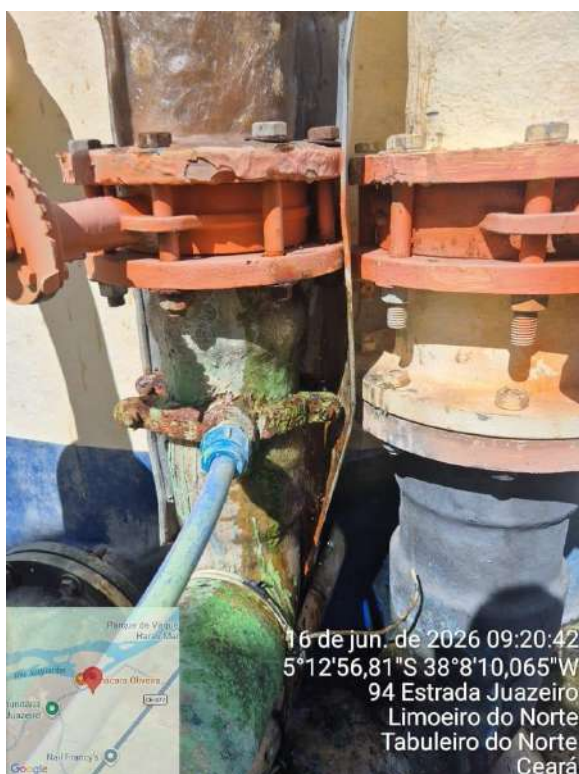
Foto 25 - ETA Tabuleiro do Norte: F-02 com vazamento na tubulação.
