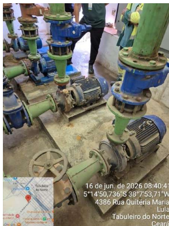
Foto 34 - EERD-02: bombas e piso com sujeira.
