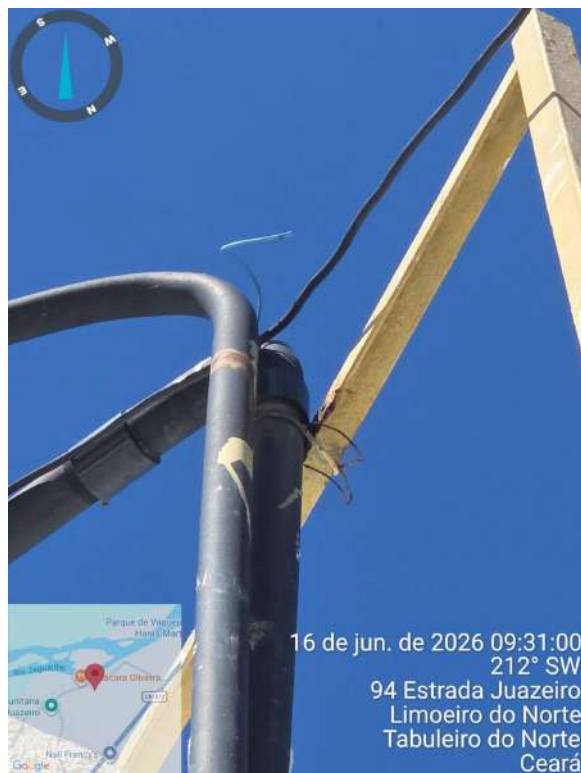
Foto 8 - ETA Tabuleiro: fiação sem eletroduto.
