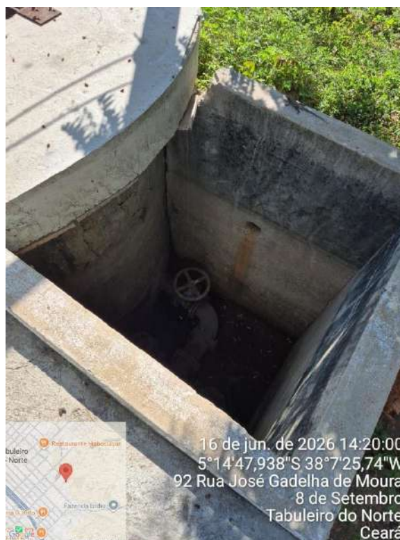
Foto 20 - ETE Tabuleiro do Norte: caixas sem tampa.
