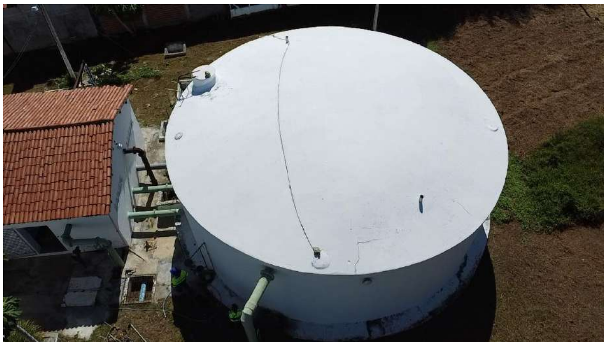
Foto 9 - ETA Tabuleiro: RAP-01 com fiação sem eletroduto e tubulação de ventilação sem formato adequado e sem tela de proteção.
