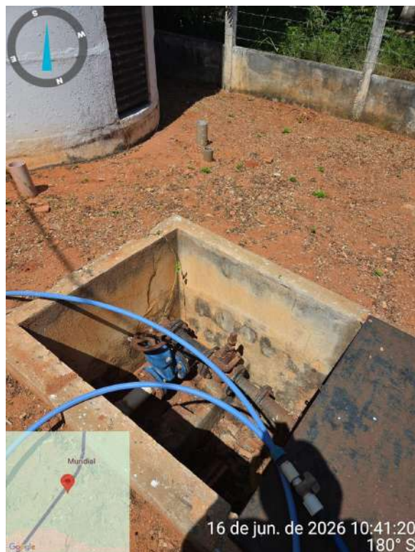
Foto 11 - EERD-07/09: caixas sem tampa/grade de proteção.
