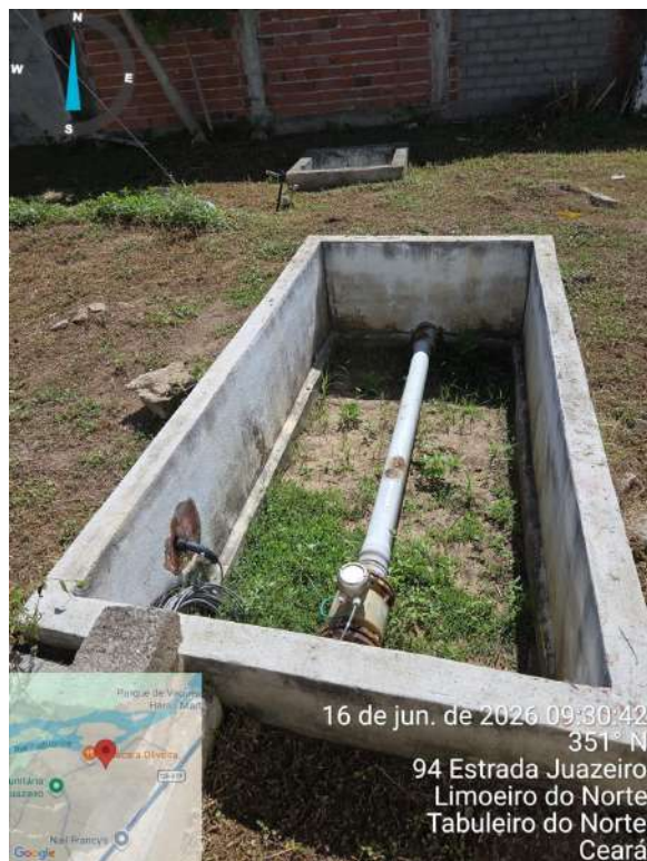
Foto 4 - ETA Tabuleiro: caixas sem tampa/grade de proteção.
