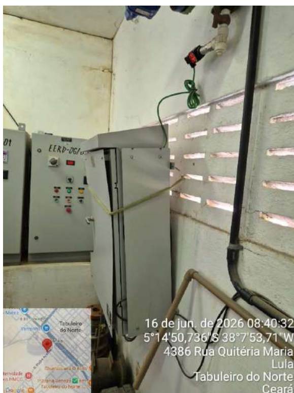
Foto 33 - EERD-02: quadro de comando desalinhado e com fixação inadequada, mantido por apoio improvisado.
