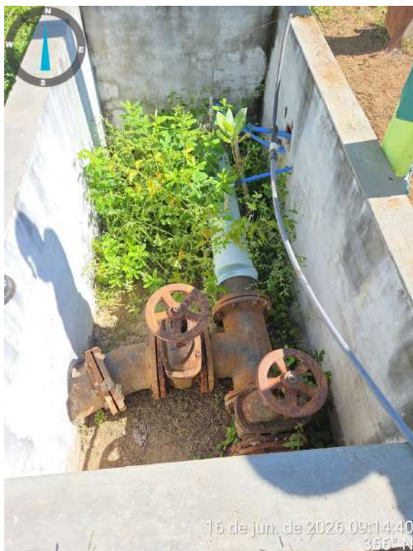
Foto 5 - ETA Tabuleiro: caixas sem tampa/grade de proteção, oxidação na tubulação e vegetação na estrutura.
