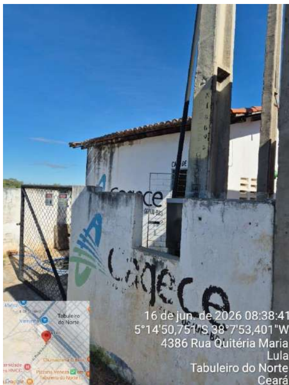
Foto 31 - EERD-02: pintura desgastada.
