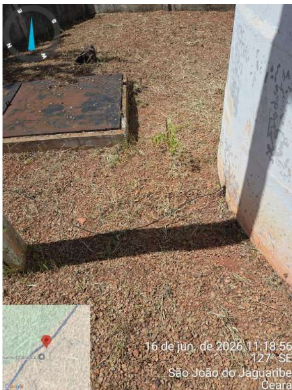
Foto 14 - REL-04: fiação sem eletroduto na área de circulação.
