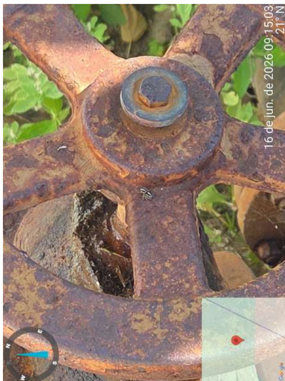
Foto 29 - ETA Tabuleiro do Norte: válvula oxidada.
