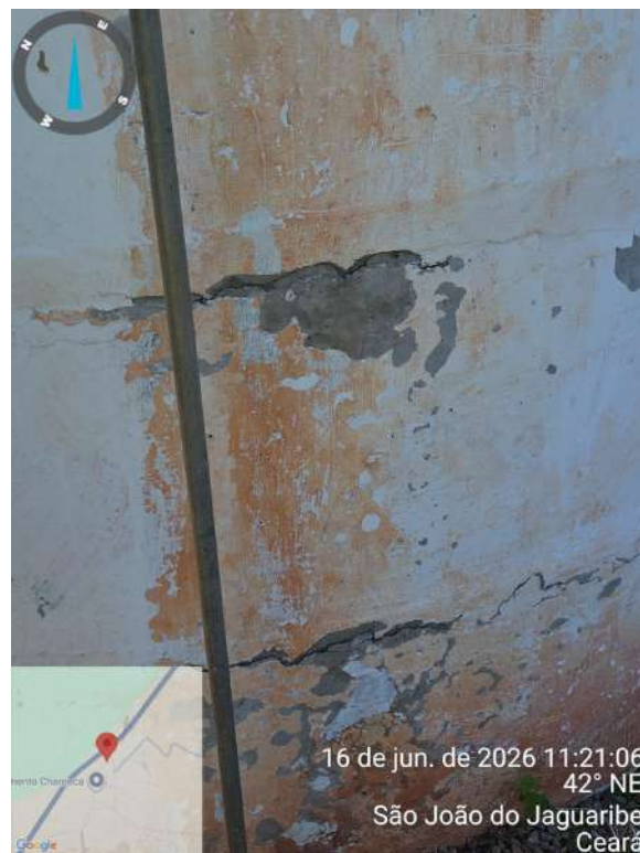
Foto 40 - REL-04: pintura desgastada e presença de rachaduras.
