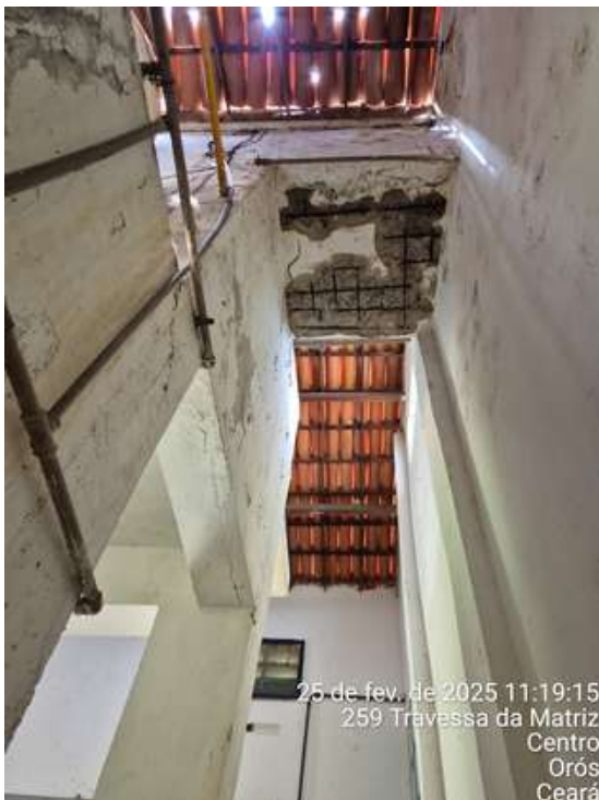
Foto 1 - ETA / CASA DE QUÍMICA: Armação das estruturas expostas, sem recobrimento, aumentando o processo de depreciação da estrutura e as fragilizando, podendo colocar em risco operadores e visitantes.
