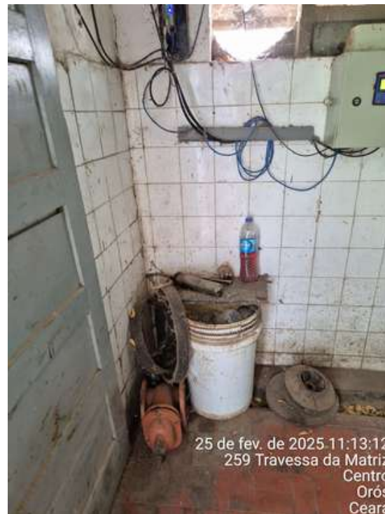
Foto 6 - ETA / Casa de bombas: Fiação sem eletrodutos.
