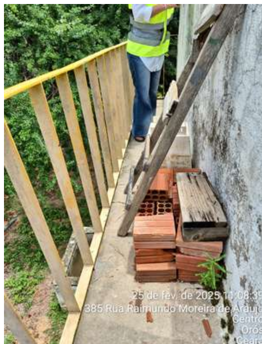
Foto 20 - ETA / Filtros e Reservatórios: Acúmulo de material de construção em local inadequado; O material disposto de forma inadequada dificulta o acesso e a manutenção aos filtros e escada de acesso é inapropriada. Piso sob a escada de madeira e os tijolos apresentam rachaduras.
