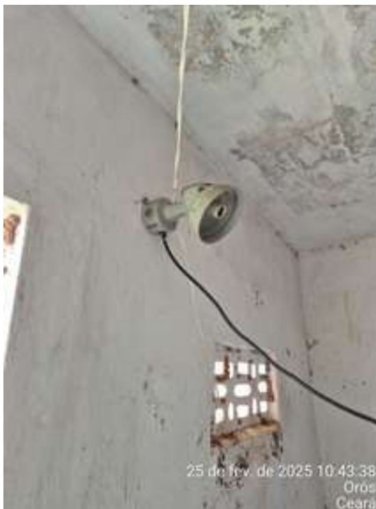
Foto 9 - Casa de Comando: Casa de comando sem lâmpada; cabos/fiação com eletrodutos danificados; Paredes com pintura desgastada.
