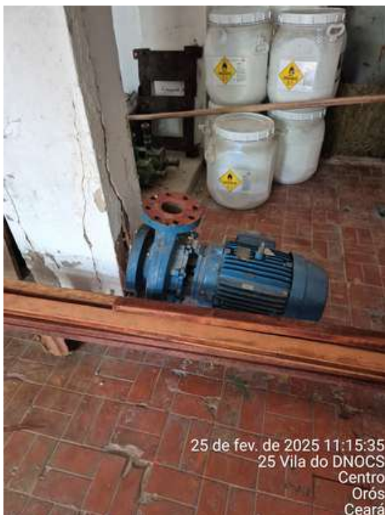
Foto 11 - ETA / Casa de Química: Bomba sem armazenamento adequado e pilar com estrutura comprometida.
