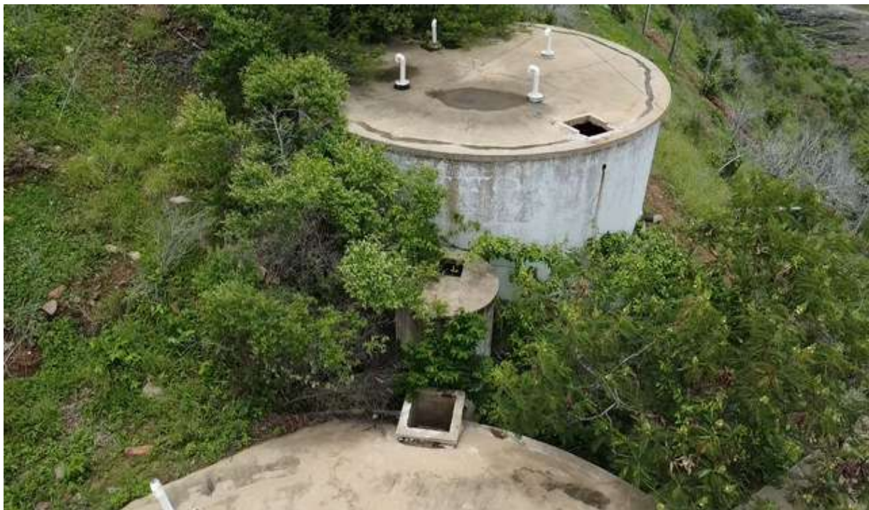
Foto 25 - RAP-03 e RAP-04: Local com difícil acesso nos períodos chuvosos devido a sem acesso, vegetação alta; reservatórios sem fechamento hermético (sujos e sem tampa).
