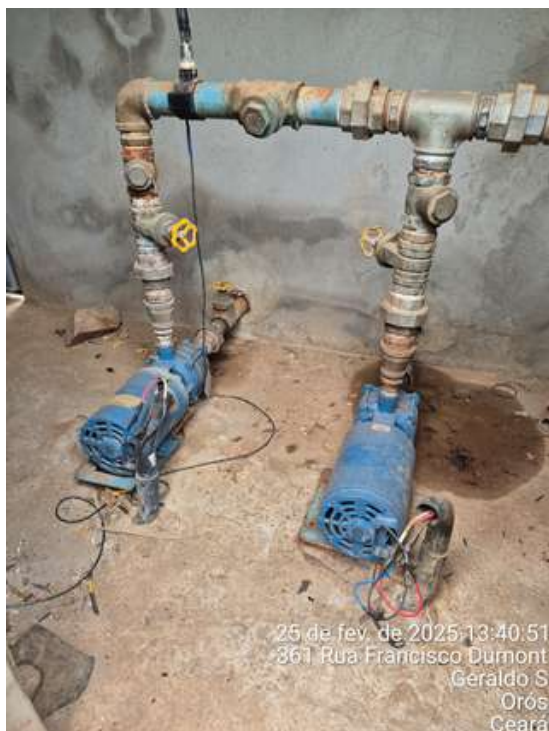
Foto 7 - RAP-06: Fiação das bombas e do painel de controle sem proteção e eletrodutos.
