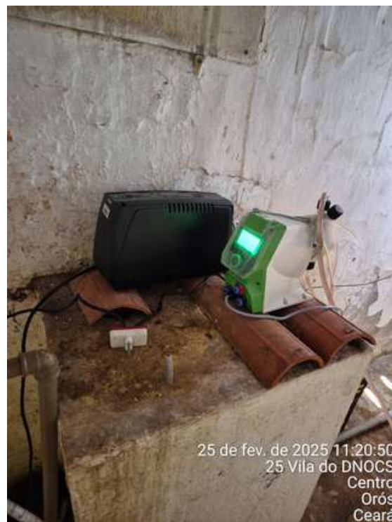
Foto 16 - ETA / Casa de Química: Suporte inadequado para equipamentos.
