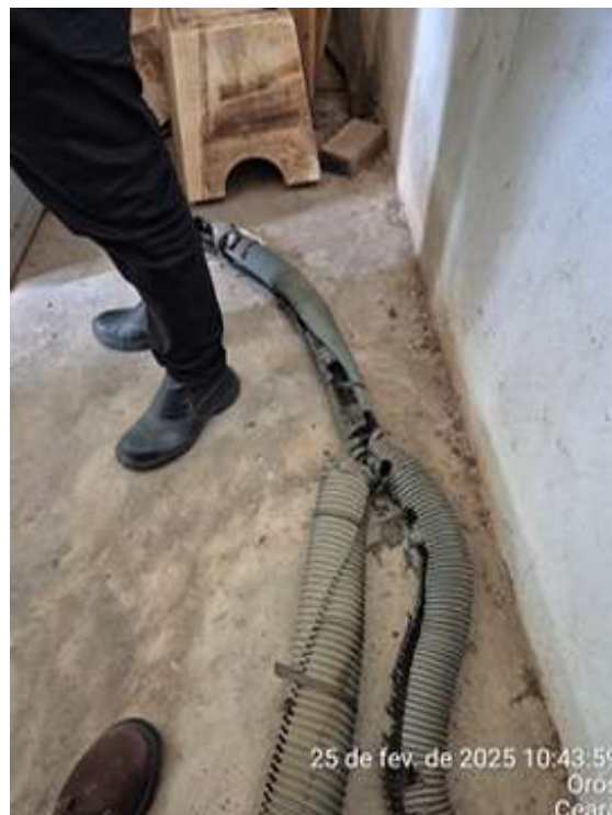
Foto 10 - Casa de Comando: Casa de comando sem lâmpada; cabos/fiação com eletrodutos danificados; Paredes com pintura desgastada.
