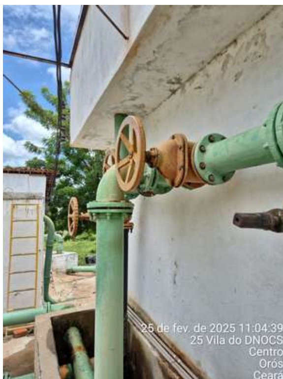
Foto 17 - ETA / Filtros e Reservatórios: Saída dos filtros e reservatórios com vazamento e pintura desgastada; estrutura metálica entre filtros em acentuada oxidação.
