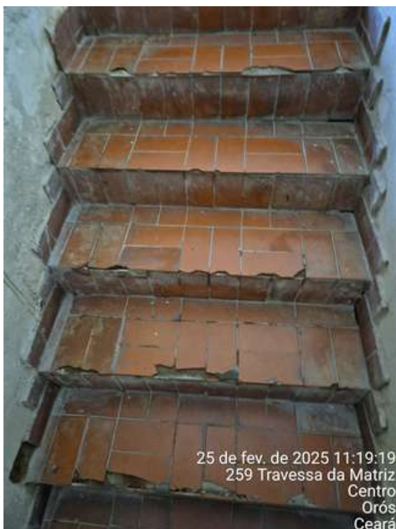
Foto 13 - ETA / Casa de Química: Piso danificado das escadas.
