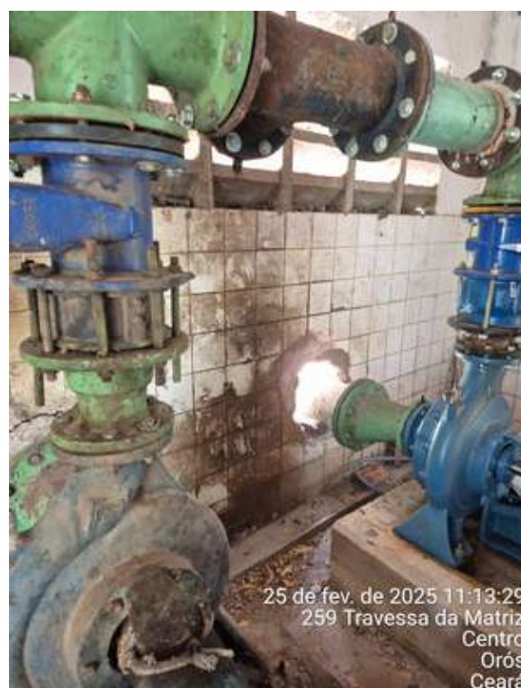
Foto 22 - ETA / Casa de Bombas: Viga oxidada; abertura na parede inadequada para tubulação da bomba; paredes sem limpeza; acúmulo de material em local inadequado.
