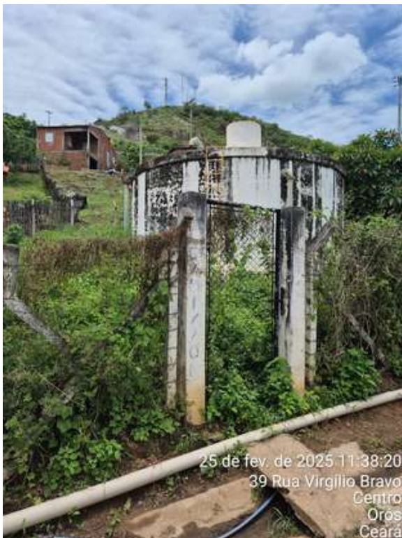
Foto 23 - RAP-02: Vegetação alta dificultando o acesso ao reservatório; sem identificação; pintura deteriorada.
