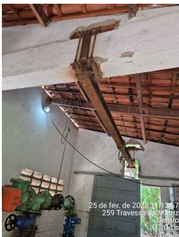
Foto 21 - ETA / Casa de Bombas: Viga oxidada; abertura na parede inadequada para tubulação da bomba; paredes sem limpeza; acúmulo de material em local inadequado.
