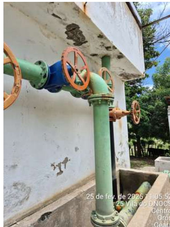
Foto 2 - ETA / Filtros e Reservatórios: Partes de armadura expostas nos reservatórios dos filtros;
