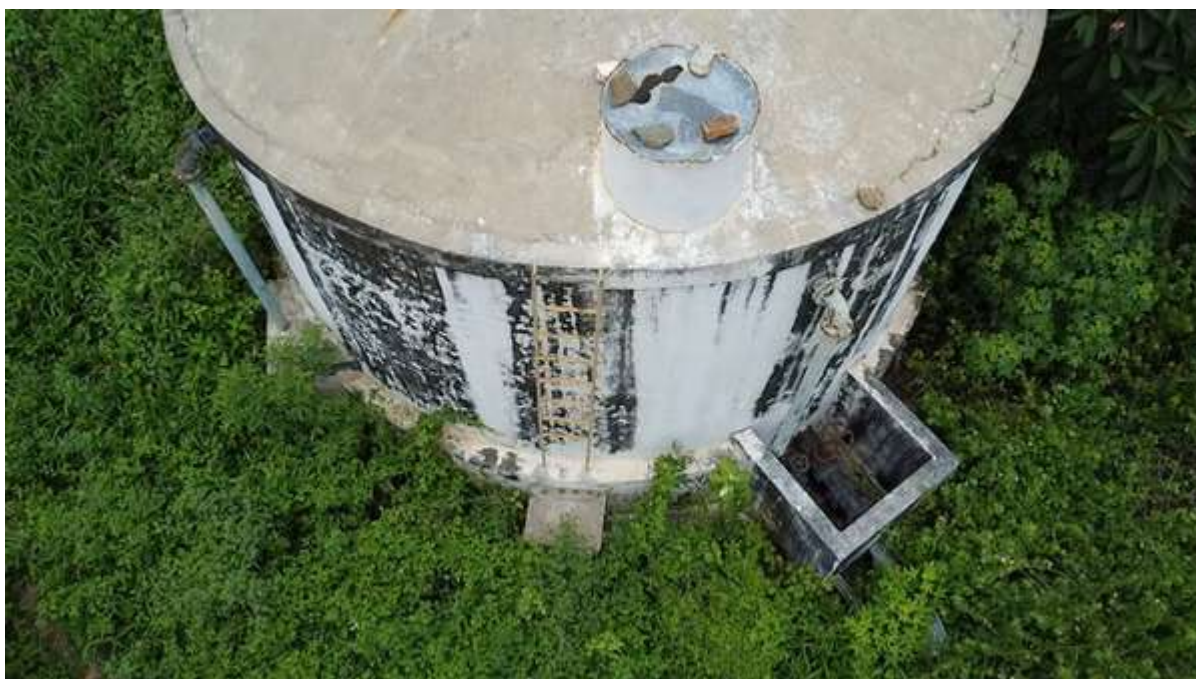
Foto 24 - RAP-02: Vegetação alta dificultando o acesso ao reservatório; sem identificação; pintura deteriorada; Reservatório está com fechamento inadequado, ou seja, não está hermeticamente fechado, situação agravada pela grande quantidade de pássaros e outros vetores sobre a estrutura.
