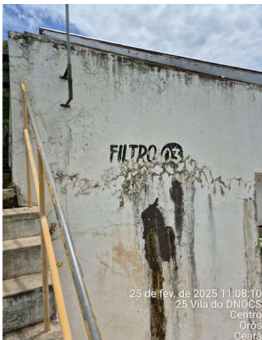
Foto 19 - ETA / Filtros e Reservatórios: Pintura desgastada.
