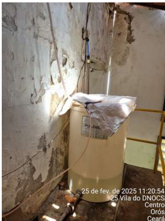
Foto 15 - ETA / Casa de Química: Equipamentos de cloração estão sobre a estrutura deteriorada, aumentando risco físico.
