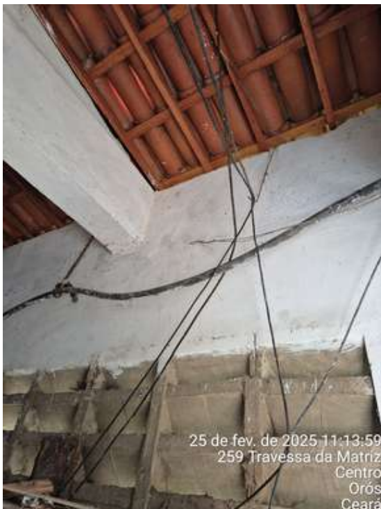
Foto 5 - ETA / Casa de bombas: Fiação sem eletrodutos.
