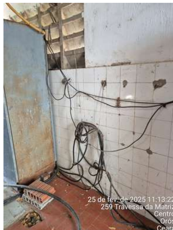
Foto 4 - ETA / Casa de bombas: Fiação sem eletrodutos.
