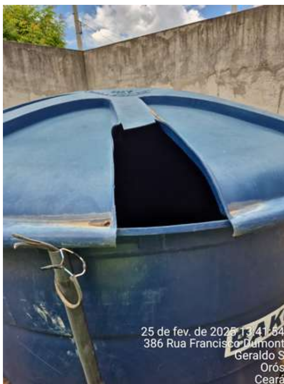
Foto 26 - RAP-06: Tampa quebrada com abertura na lateral do reservatório (Não está hermeticamente fechado, aumentando risco de contaminação); vegetação alta; tubulação com fiação antiga.
