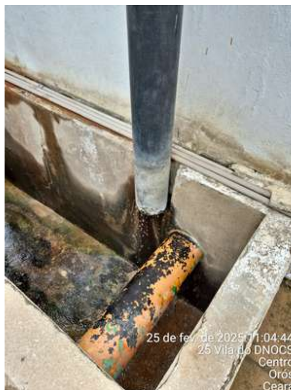
Foto 18 - ETA / Filtros e Reservatórios: Saída dos filtros e reservatórios com vazamento e pintura desgastada; estrutura metálica entre filtros em acentuada oxidação.
