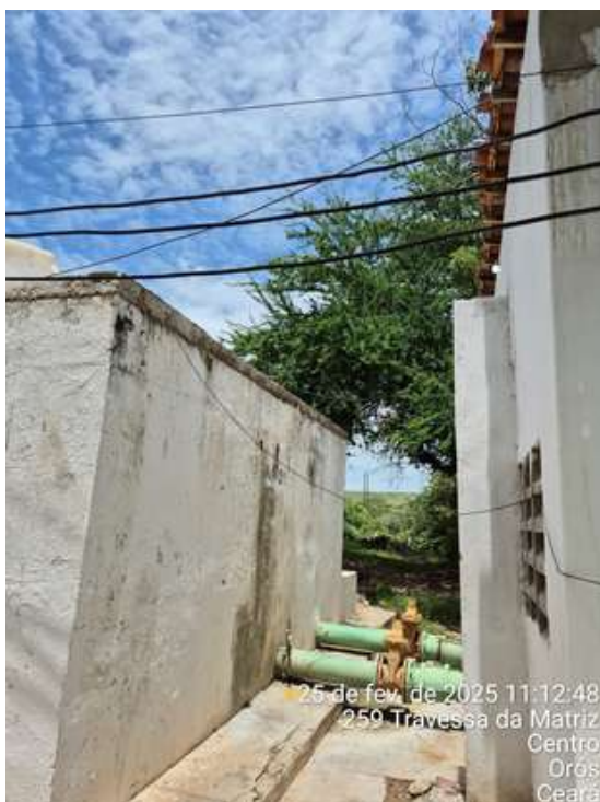
Foto 3 - ETA / Filtros e Reservatórios: Partes de armadura expostas nos reservatórios dos filtros; fiação caída.
