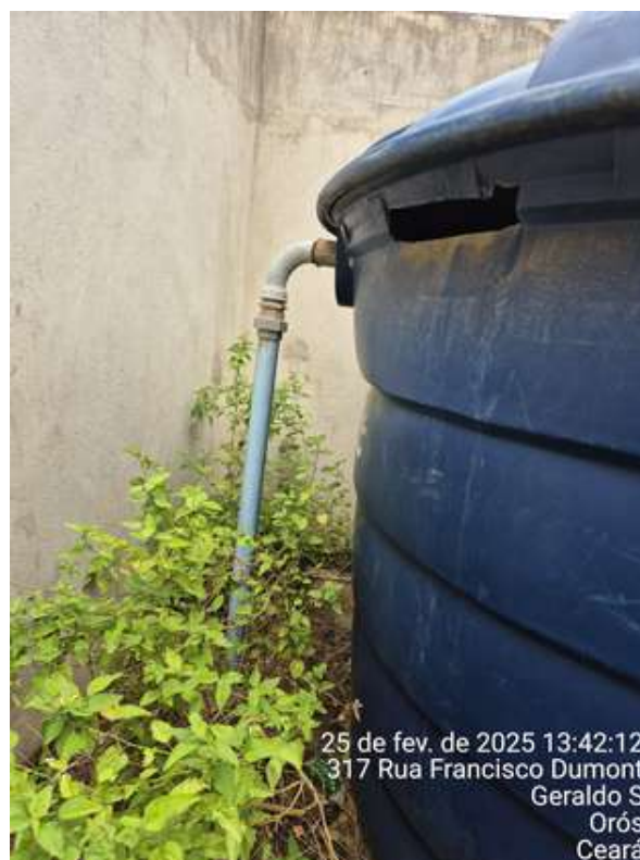
Foto 27 - RAP-06: Reservatório quebrado (Não está hermeticamente fechado, aumentando risco de contaminação);
