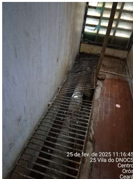
Foto 12 - ETA / Casa de Química: Grades de tubulação soltas e oxidadas.
