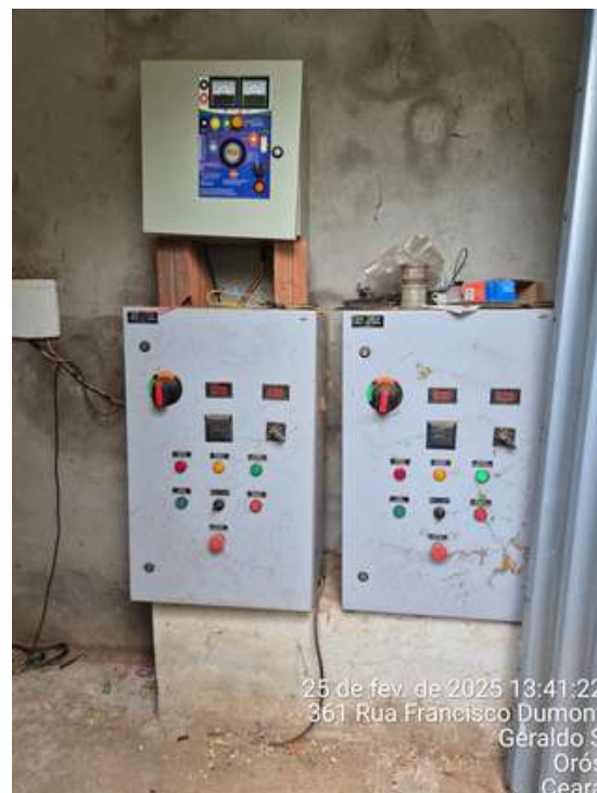
Foto 8 - RAP-06: Fiação das bombas e do painel de controle sem proteção e eletrodutos.
