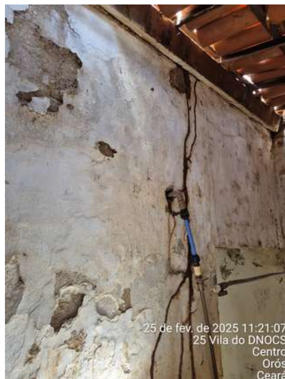
Foto 14 - ETA / Casa de Química: Sinais de infiltração e falta de manutenção do acabamento das paredes.
