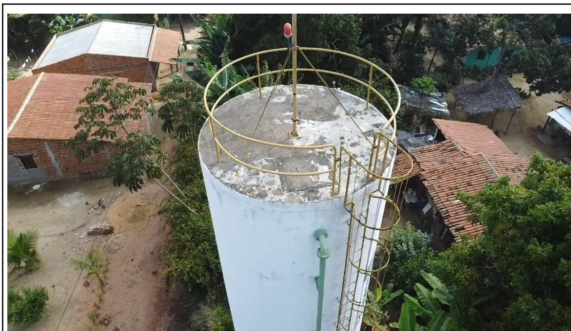
Foto 1 - REL-09: ausência de cerca de proteção para isolamento e delimitação da área .
