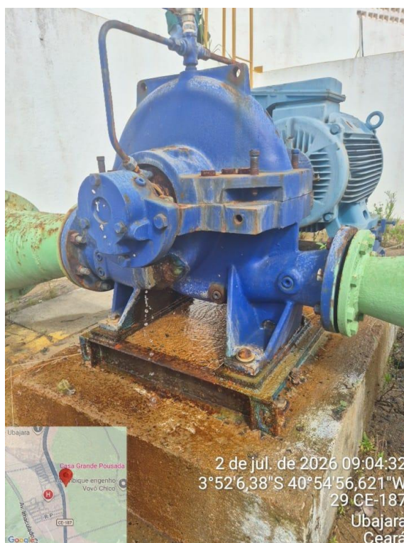
Foto 9 - RAP-08 / EEAT-04: vazamento nas bombas.
