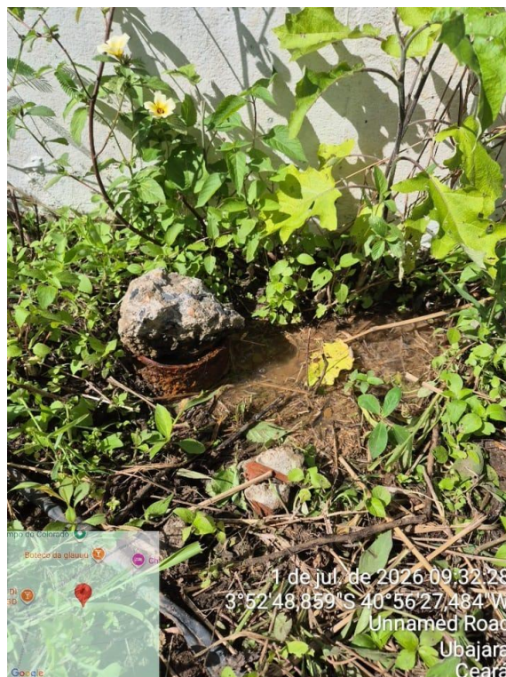
Foto 6 - RAP-07: vazamento no registro.
