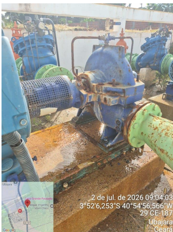
Foto 8 - RAP-08 / EEAT-04: vazamento nas bombas.
