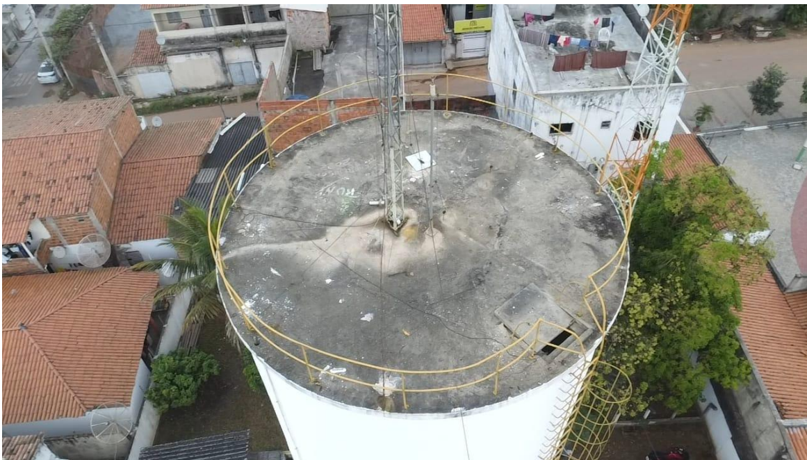
Foto 4 - REL-10: tampa deslocada.
