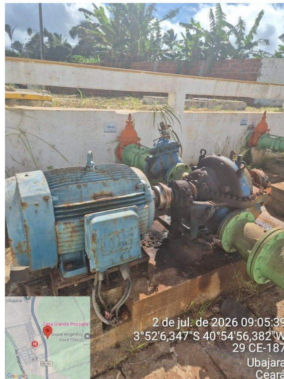
Foto 11 - RAP-08 / EEAT-04: vazamento nas bombas e fiação exposta
