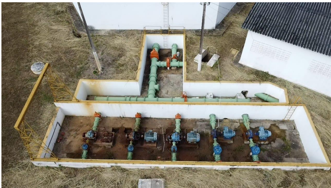
Foto 7 - RAP-08 / EEAT-04: vazamento nas bombas.
