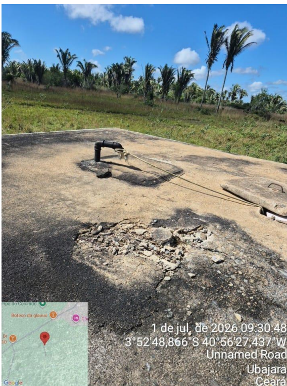
Foto 5 - RAP-07: laje do reservatório danificada.
