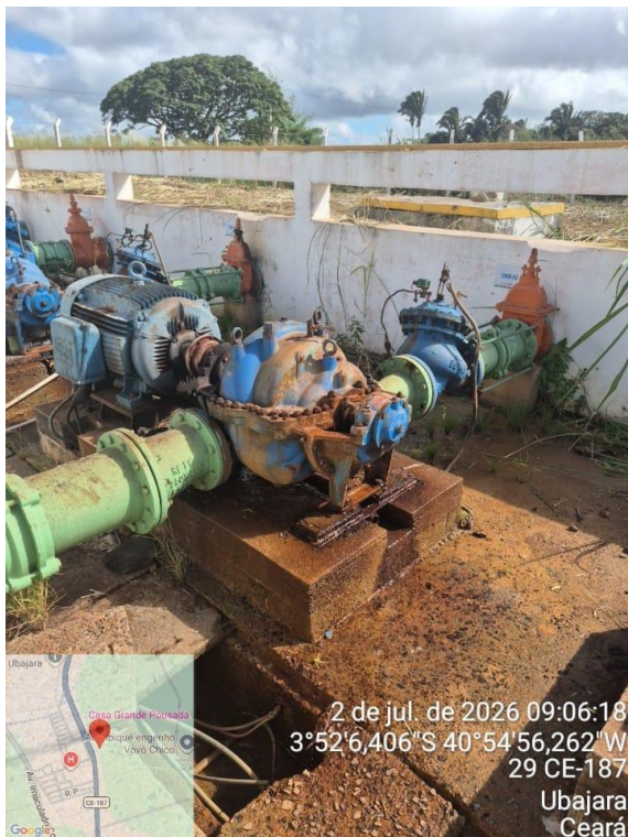
Foto 10 - RAP-08 / EEAT-04: vazamento nas bombas e fiação exposta.
