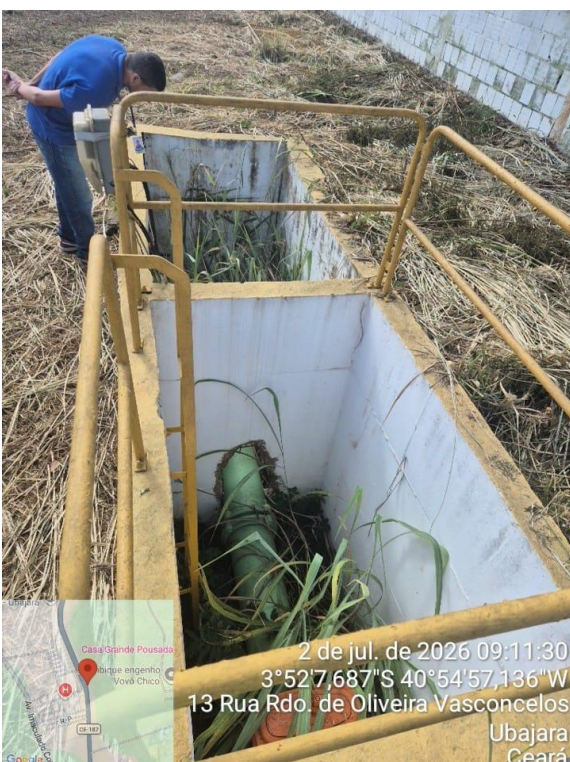
Foto 13 - caixas com excesso de vegetação
