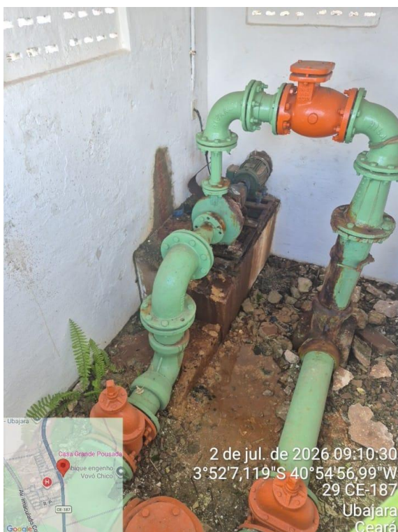
Foto 12 - Booster com vazamento.
