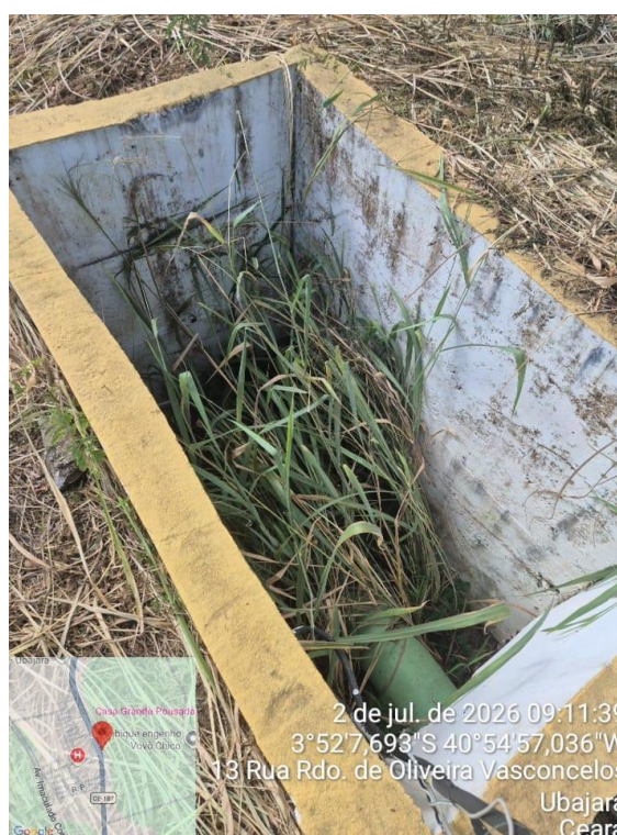
Foto 3 - RAP-08 / EEAT-04: caixa sem grade de proteção.
