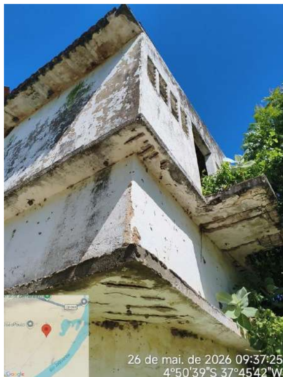
Foto 72 - Poço Amazonas: unidade desativada e fora de operação, com sinais de abandono; tomada pela vegetação e com anomalias estruturais.
