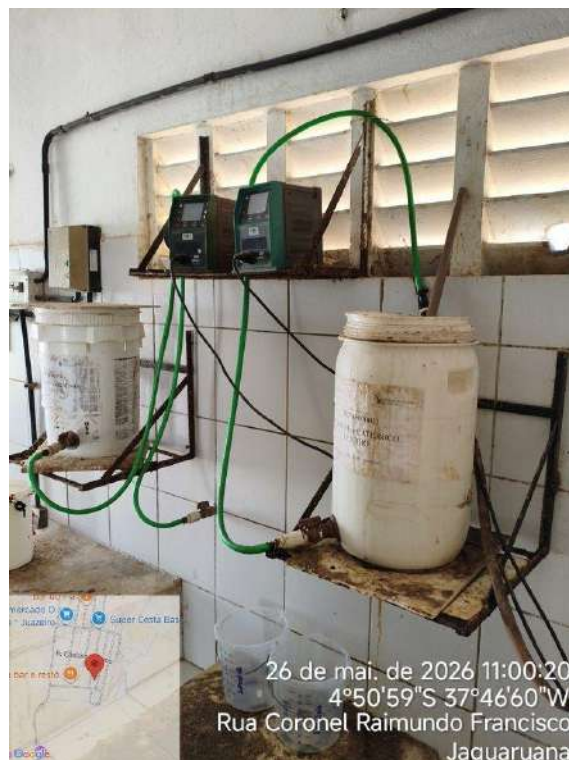
Foto 53 - Laboratório e Casa de Química: base do tanque de polímero em processo avançado de corrosão / oxidação.
