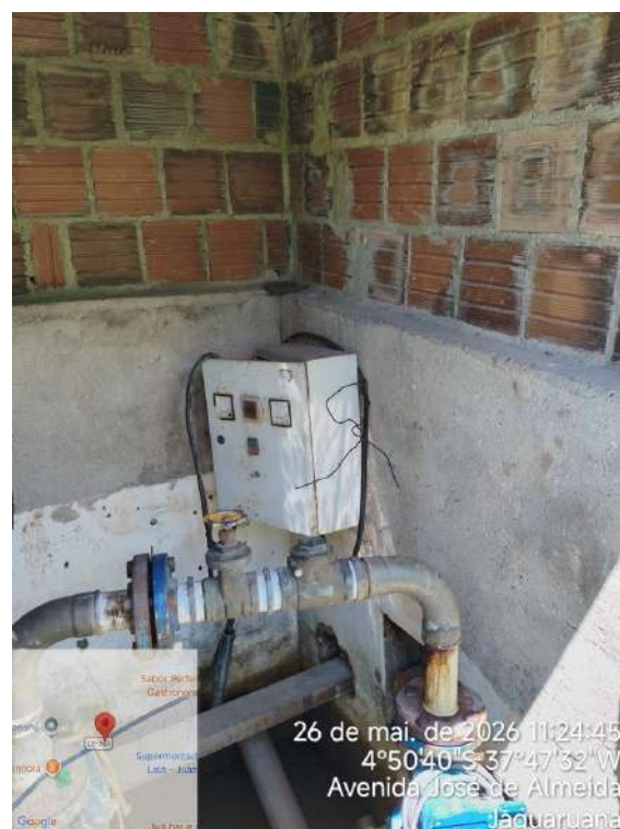
Foto 30 - EERD-02: instalações elétricas em situação precárias.
