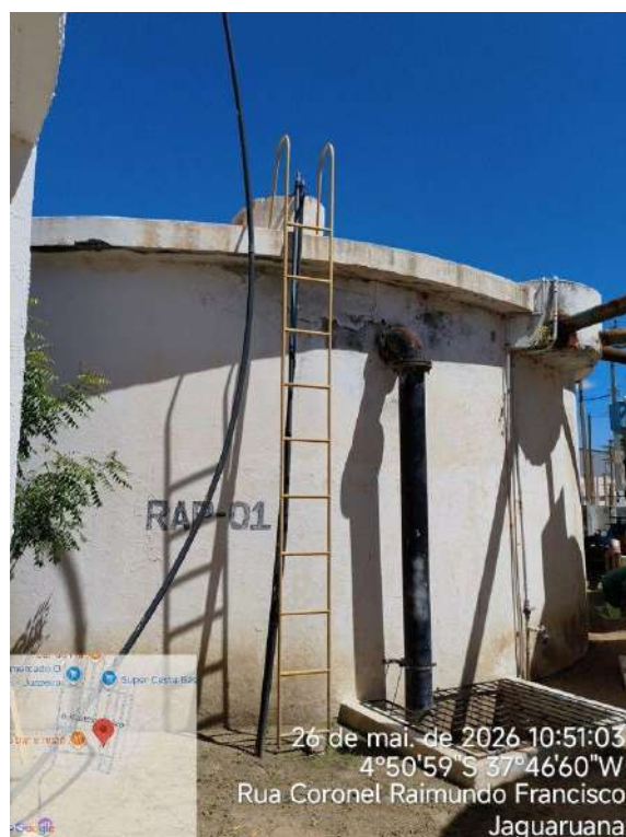
Foto 19 - ETA / RAP-01: escada sem gaiola e grade de proteção acima do patamar / laje de cobertura, pintura deteriorada.
