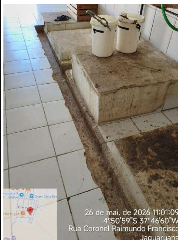
Foto 22 - ETA / Laboratório / Casa de Química / Instalações de Apoio: Calha de piso desprovida de proteção.
