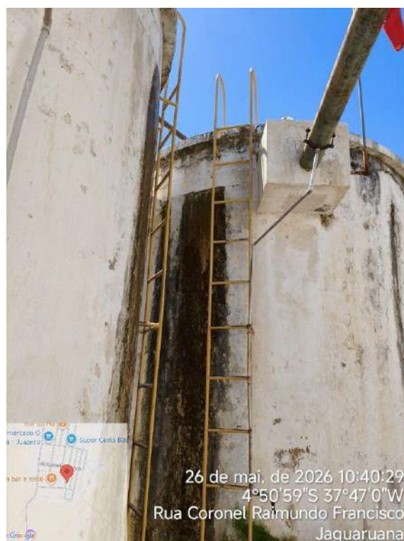
Foto 16 - ETA / Filtros: escadas de acesso inadequadas, sem gaiola de proteção; rachaduras / fissuras e vazamentos.
