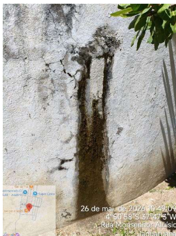
Foto 55 - RAP-01: Pintura deteriorada; vazamento.
