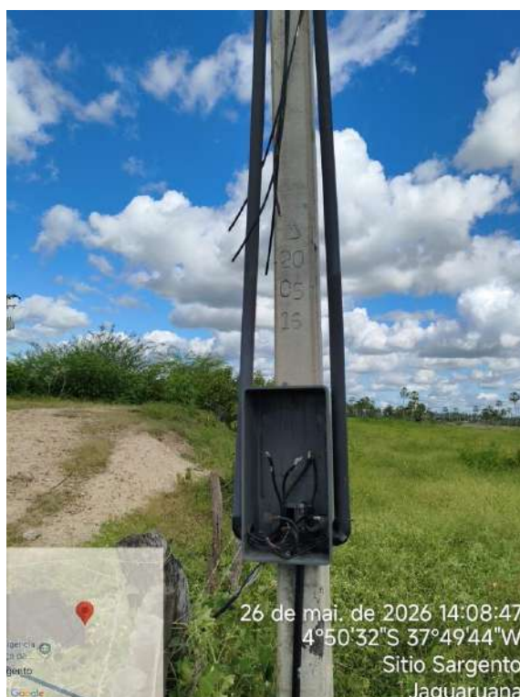
Foto 69 - Poço Tubular: unidade desativada e fora de operação, com sinais de abandono; cabeamento remanescente exposto.
