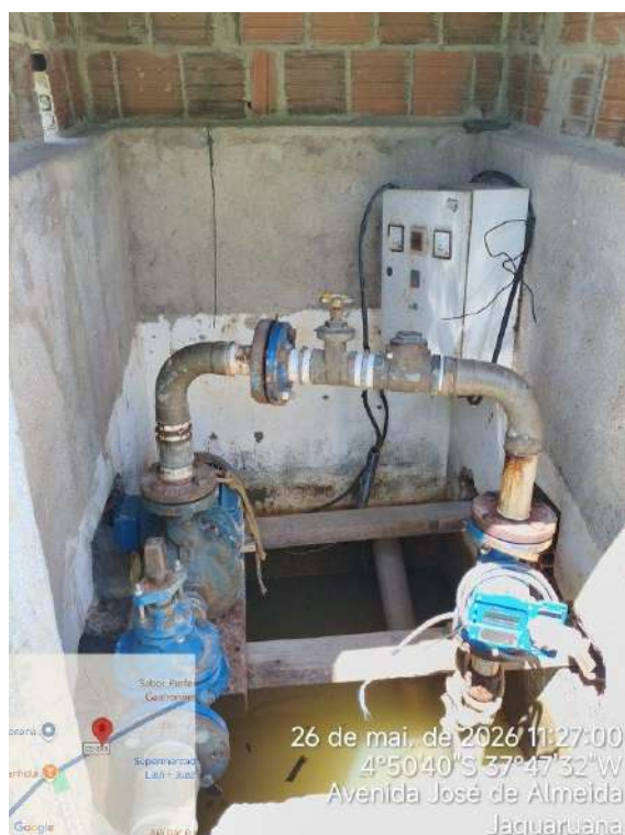
Foto 29 - EERD-02: área interna inundada, desprovida de plataforma e instalações elétricas em situação precárias.
