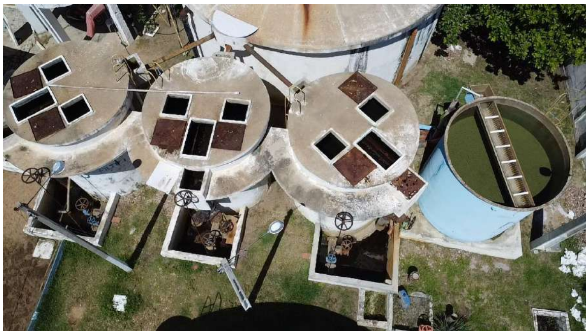
Foto 15 - ETA / Filtros: filtro sem cobertura e tampas das aberturas de inspeção deterioradas.
