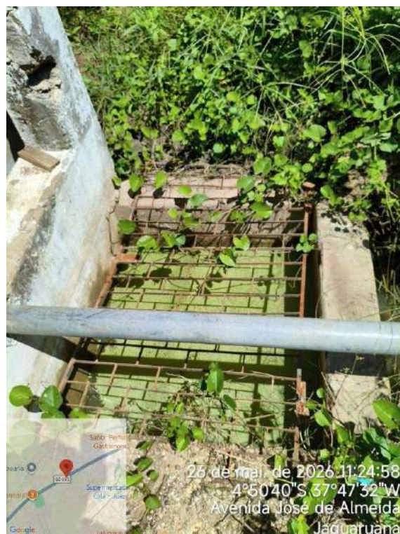
Foto 58 - EERD-02: porta de acesso arrancada sobre a caixa em frente.
