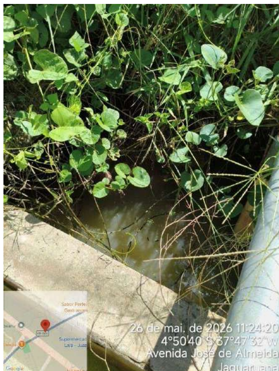
Foto 31 - EERD-02: caixas desprovidas de tampas, inundadas e tomadas pela vegetação à frente da porta de acesso.
