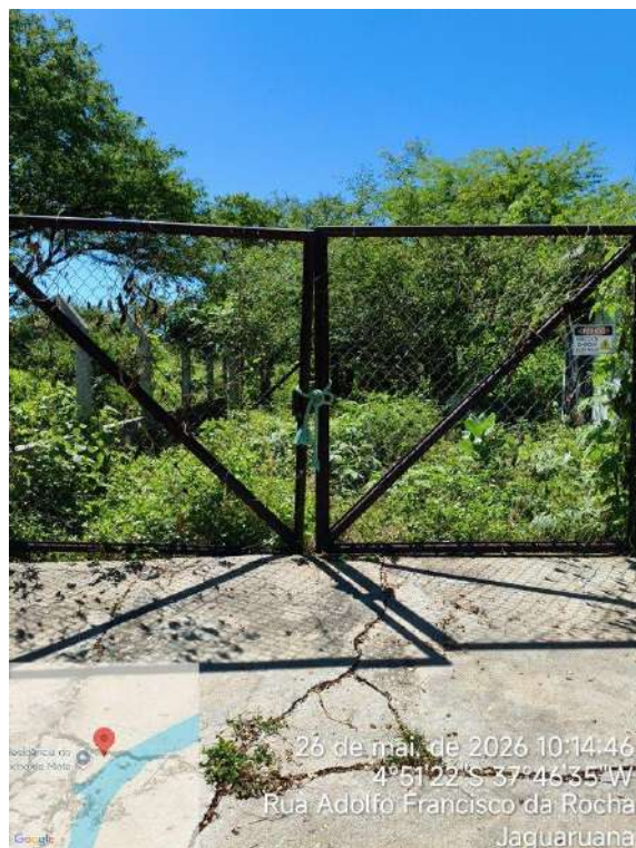
Foto 1 - Captação / Quadro de Comando: portão desprovido de tranca.
