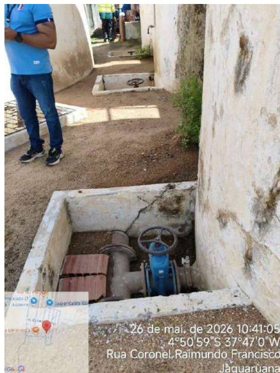
Foto 10 - ETA / Pátio: Caixas sem tampa ou grade de proteção.
