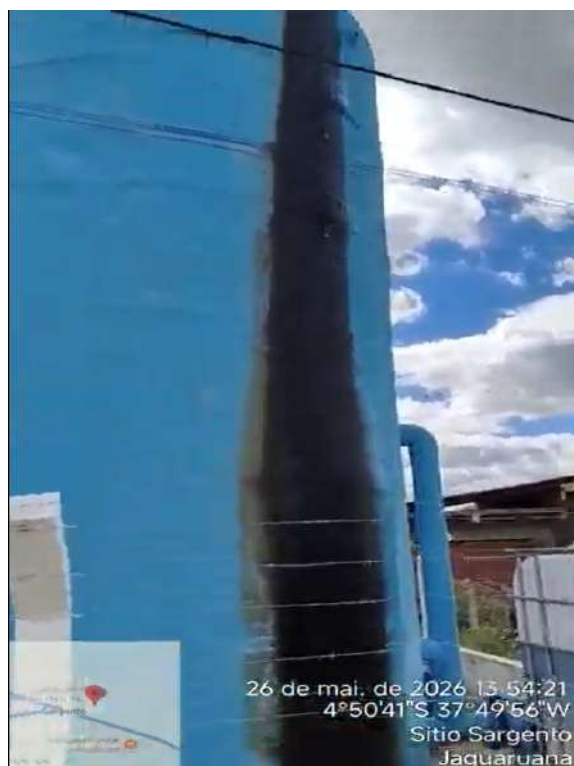
Foto 74 - RAP-03: unidade operada pelo SISAR; sinais de transbordamento.
