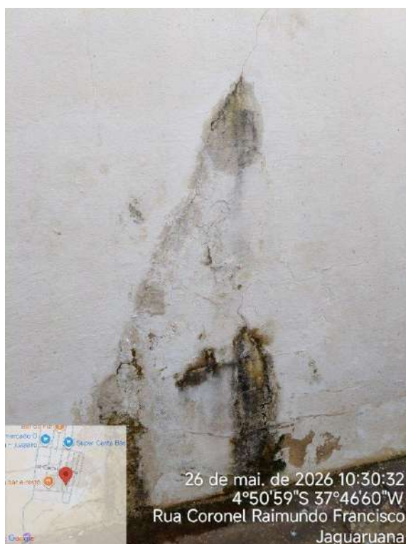
Foto 46 - Floco decantador: vazamento.
