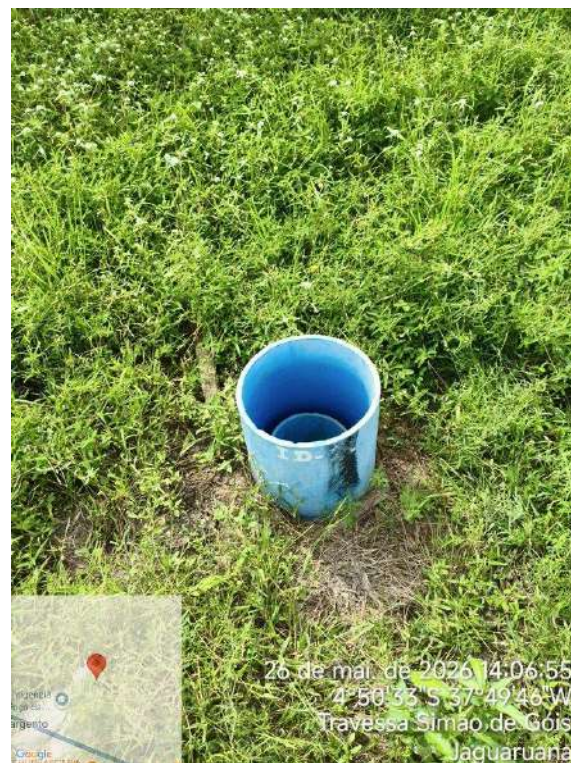
Foto 66 - Poço Tubular: unidade desativada e fora de operação, com sinais de abandono; poço sem tamponamento.
