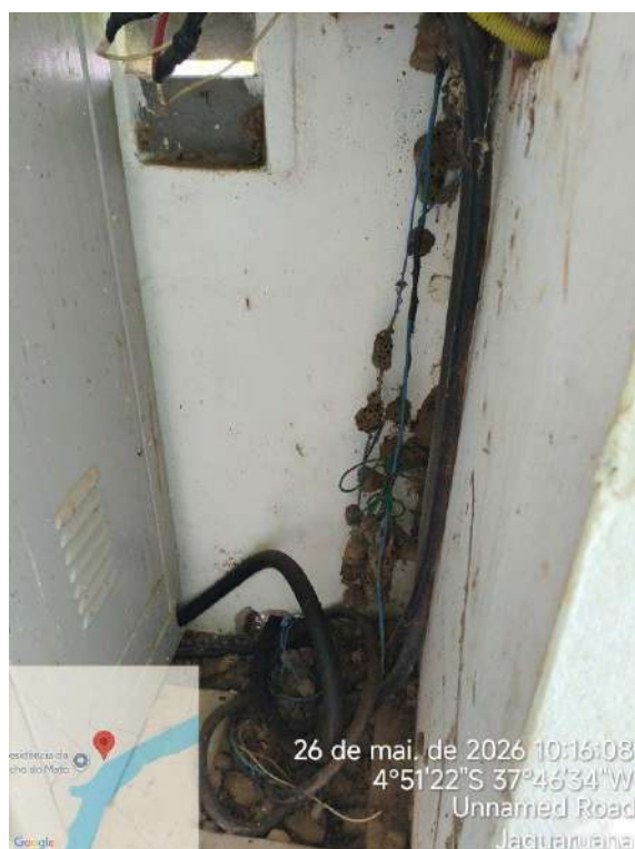
Foto 3 - Captação / Quadro de Comando: instalações elétricas precárias.
