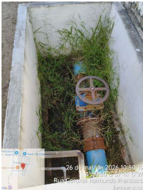
Foto 13 - ETA / Pátio: Caixa sem tampa ou grade de proteção.
