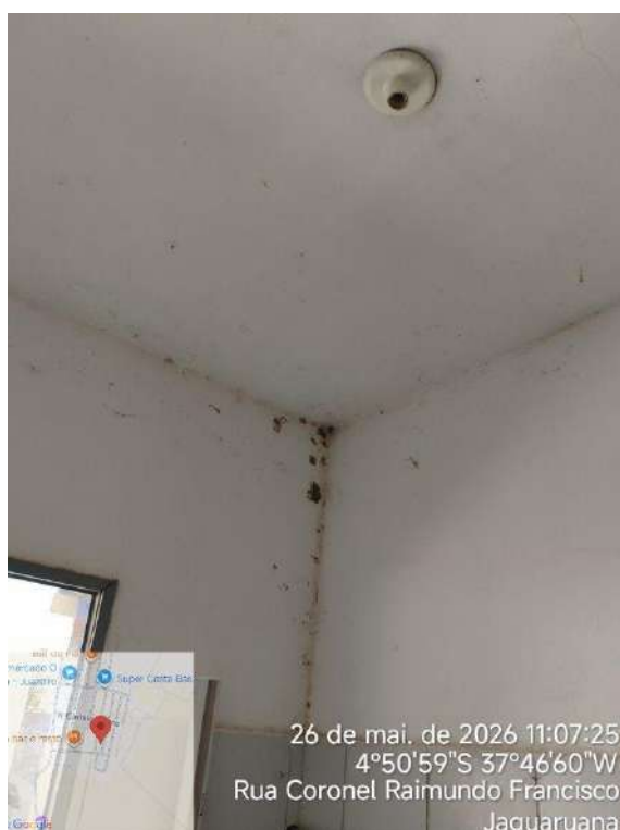
Foto 54 - Laboratório e Casa de Química: ausência de lâmpada; paredes com sujidades.
