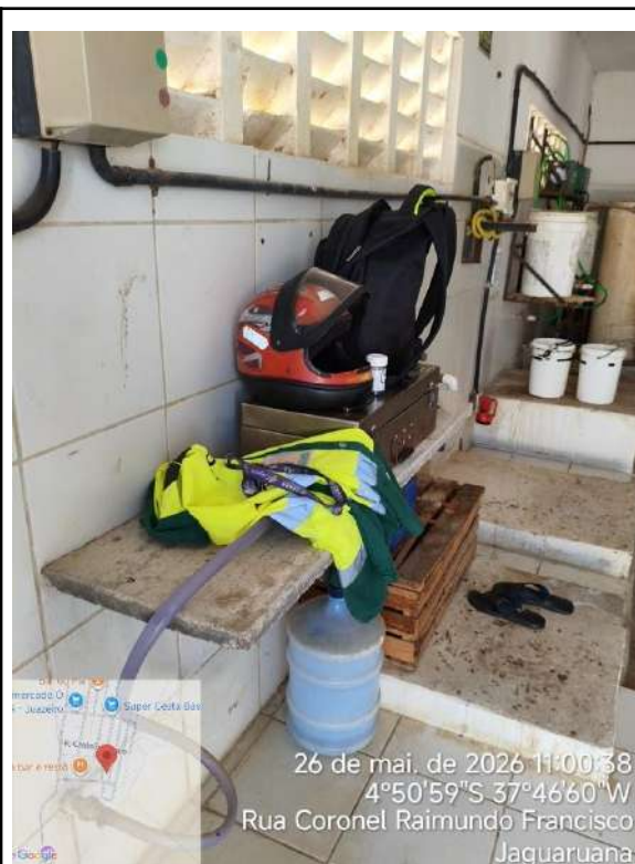
Foto 24 - ETA / Laboratório / Casa de Química / Instalações de Apoio: espaço de apoio aos operadores é improvisado, instalado junto à casa de química.
