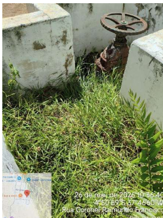
Foto 8 - ETA / Pátio: Caixa sem tampa ou grade de proteção.
