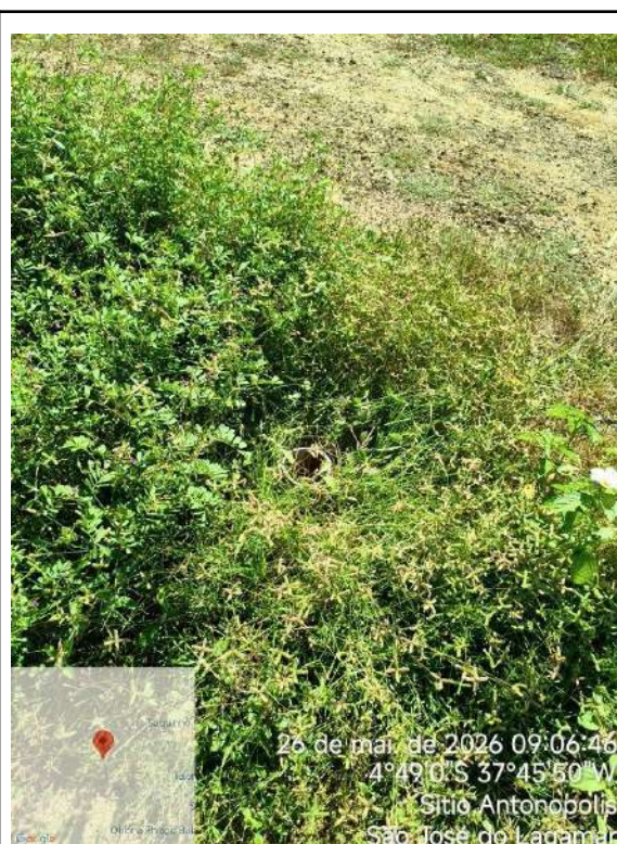
Foto 36 - Caixa de descarga (Saquinho): unidade desprovida de caixa de proteção.
