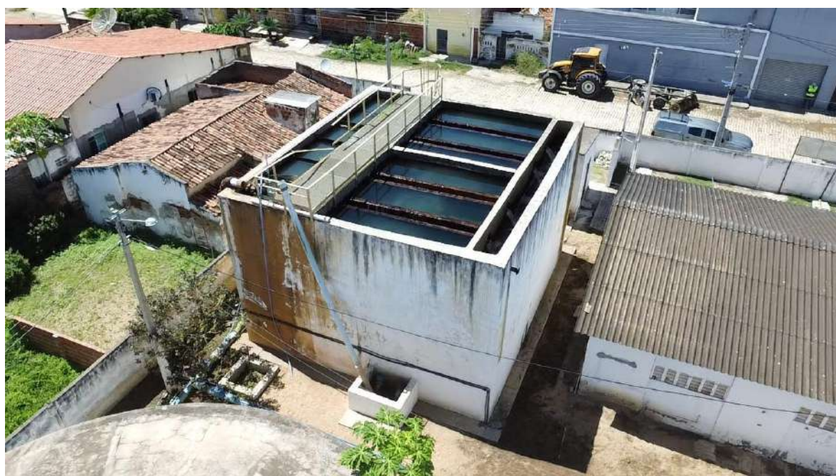
Foto 45 - ETA / Floco decantador: com pintura e grade de proteção da plataforma deterioradas.
