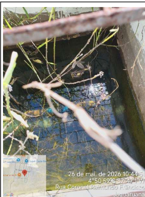
Foto 41 - ETA / Pátio: caixa com acúmulo de água.
