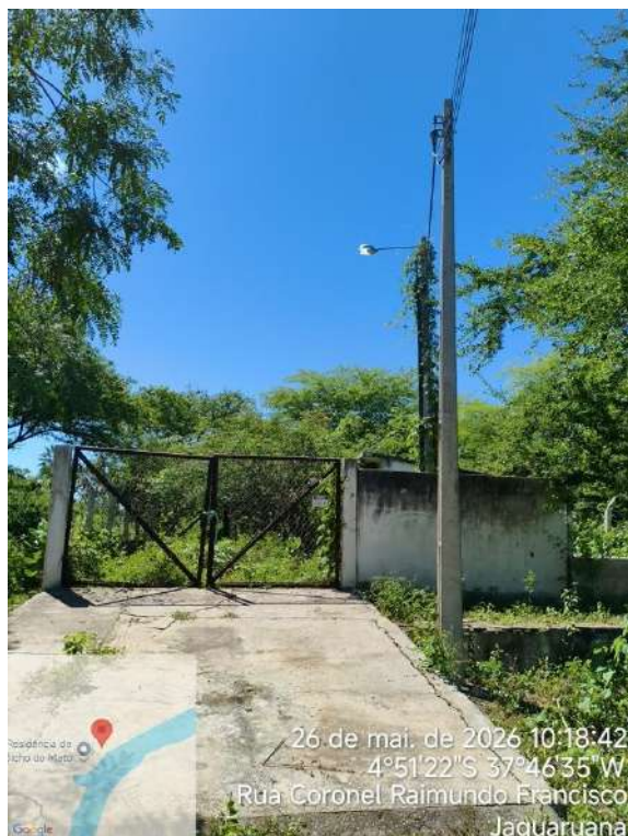
Foto 37 - Captação / Quadro de Comando: pintura e identificação desgastadas e proliferação de vegetação.
