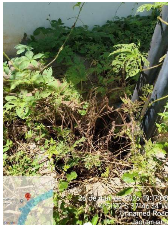
Foto 2 - Captação / Quadro de Comando: caixa desprovida de tampa.
