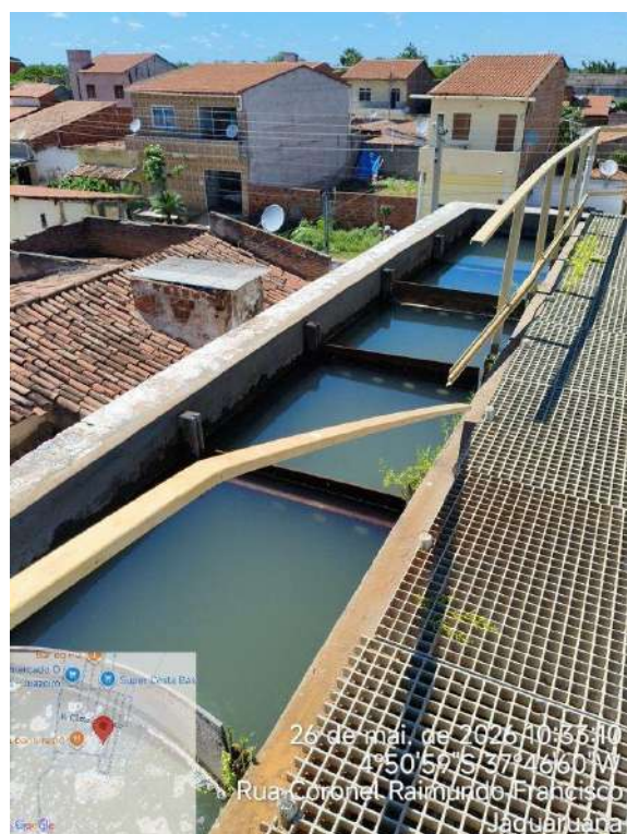
Foto 47 - Floco decantador: grade de proteção da plataforma deteriorada; proliferação de vegetação.
