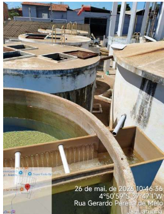
Foto 14 - ETA / Filtros: ausência de cobertura.
