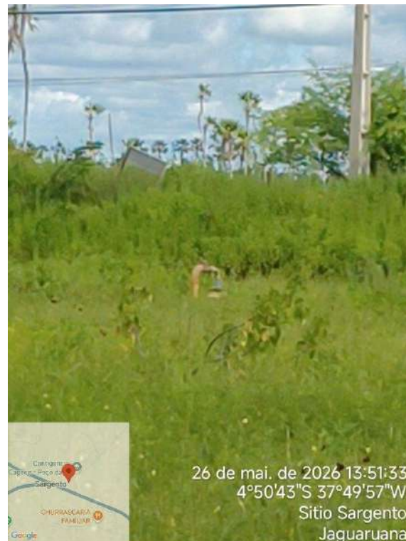
Foto 64 - Poço Tubular: unidade desativada e fora de operação, com sinais de abandono; poço sem isolamento perimetral.
