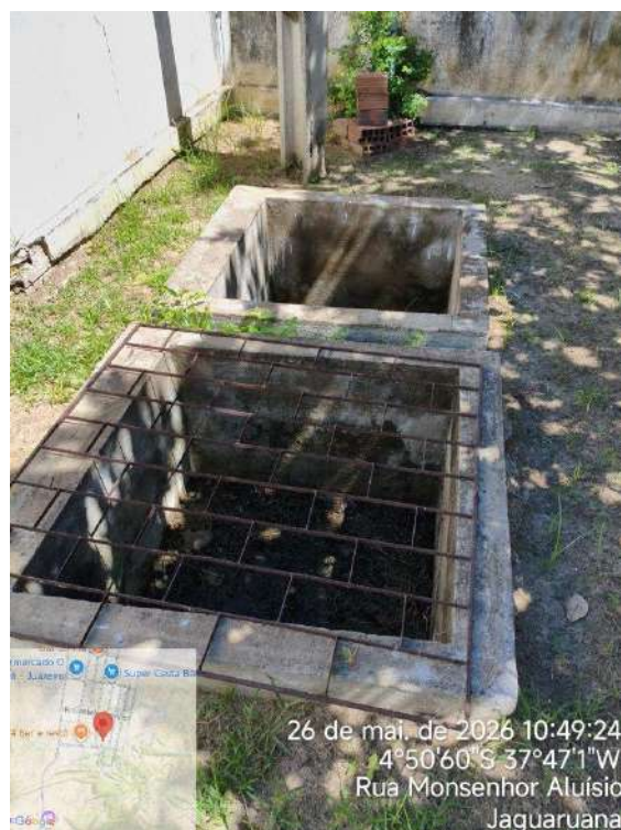
Foto 12 - ETA / Pátio: caixa desprovida de tampa.
