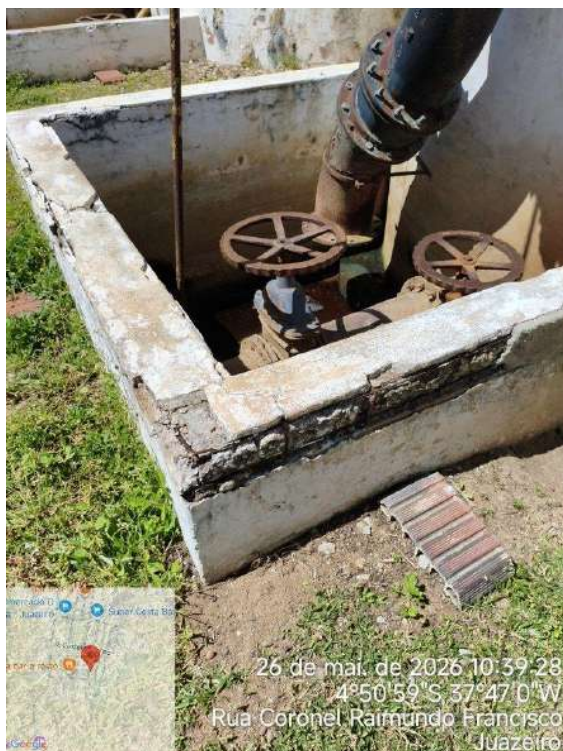
Foto 9 - ETA / Pátio: Caixa sem tampa ou grade de proteção.
