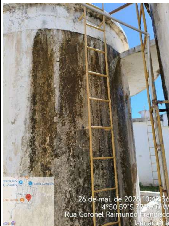
Foto 17 - ETA / Filtros: escadas de acesso inadequadas, sem gaiola de proteção; rachaduras / fissuras e vazamentos.
