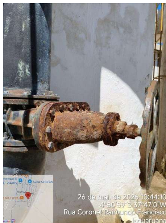
Foto 51 - Filtros: registro em processo corrosivo.
