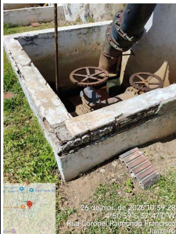
Foto 44 - ETA / Pátio: caixas deterioradas.
