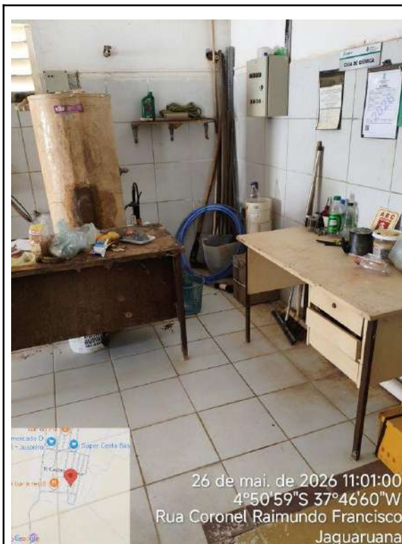
Foto 23 - ETA / Laboratório / Casa de Química / Instalações de Apoio: espaço de apoio aos operadores é improvisado, instalado junto à casa de química.
