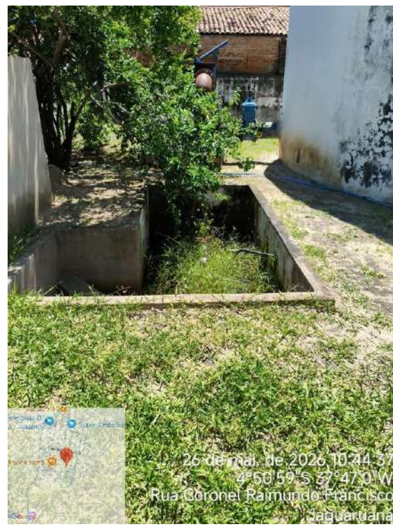
Foto 6 - ETA / Pátio: Caixa sem tampa ou grade de proteção.
