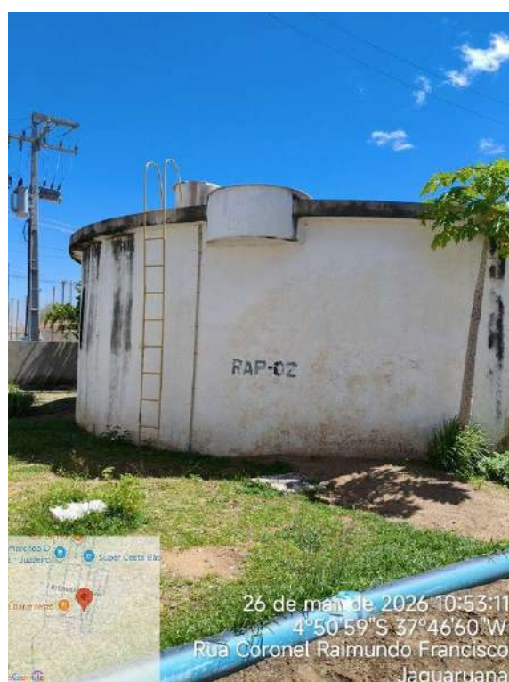
Foto 21 - ETA / RAP-02: escada sem gaiola e grade de proteção acima do patamar / laje de cobertura.
