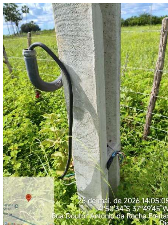
Foto 70 - Poço Tubular: unidade desativada e fora de operação, com sinais de abandono; cabeamento remanescente exposto.
