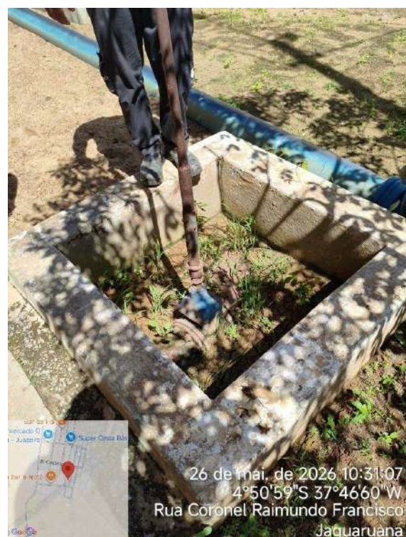
Foto 7 - ETA / Pátio: Caixa sem tampa ou grade de proteção.
