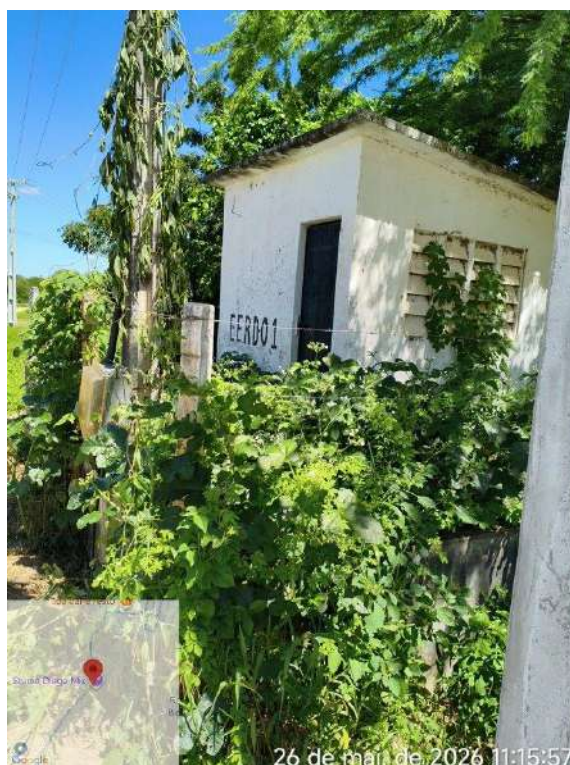
Foto 61 - EERD-01: unidade desativada e fora de operação, com sinais de abandono; crescimento de vegetação.
