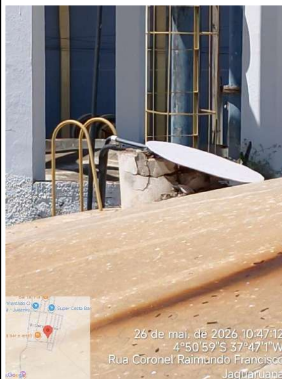
Foto 20 - ETA / RAP-01: instalações elétrica e hidráulica conduzidas através da abertura de inspeção, sem eletrodutos de proteção, chaminé deteriorada.
