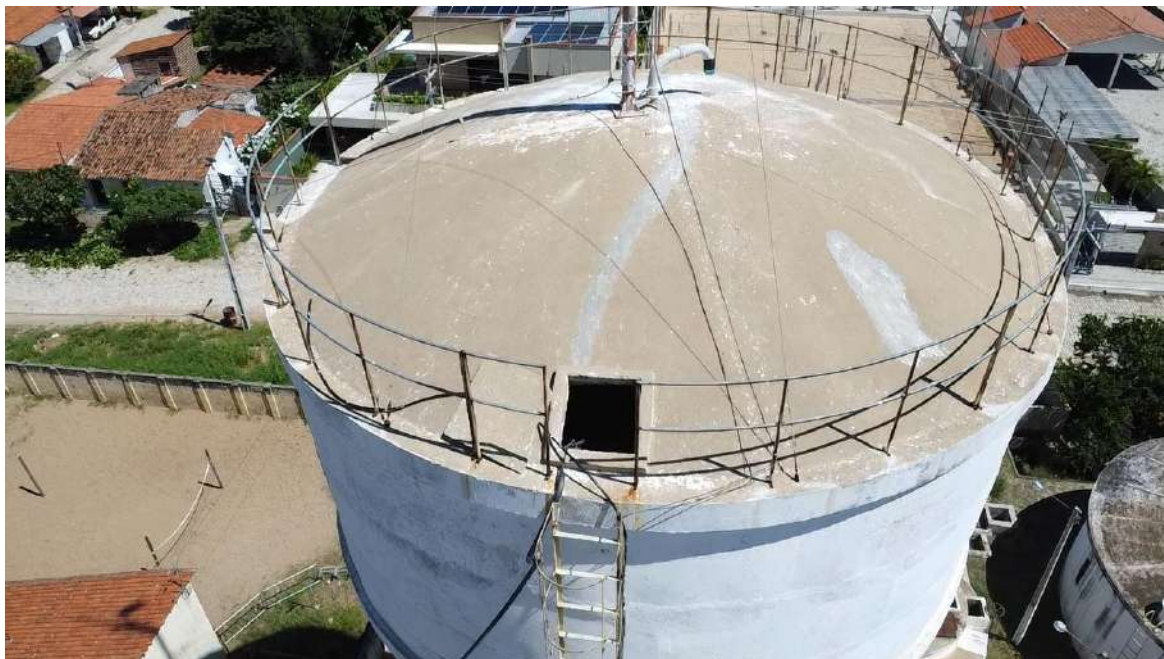
Foto 56 - REL-01: tampa de abertura de inspeção aberta e danificada.
