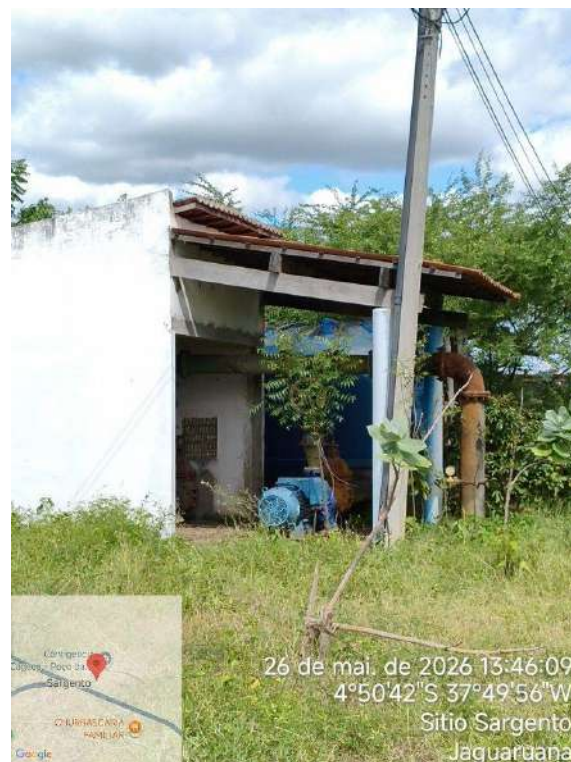
Foto 60 - RAP-04 / RAP-05 / EERD-01: unidades desativadas e fora de operação, com sinais de abandono; equipamentos remanescentes.
