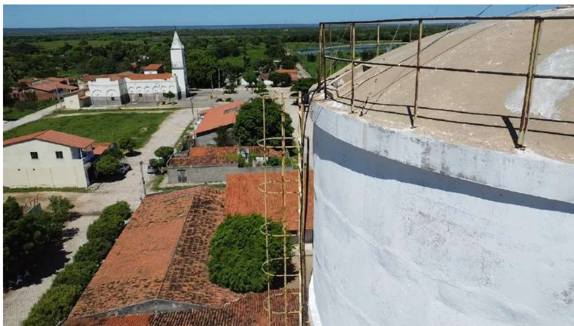
Foto 18 - ETA / REL-01: escada de acesso incompleta, sem trecho da gaiola de proteção acima do patamar superior / laje de cobertura.
