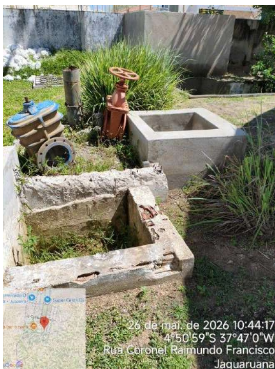
Foto 11 - ETA / Pátio: caixas desprovidas de tampa.
