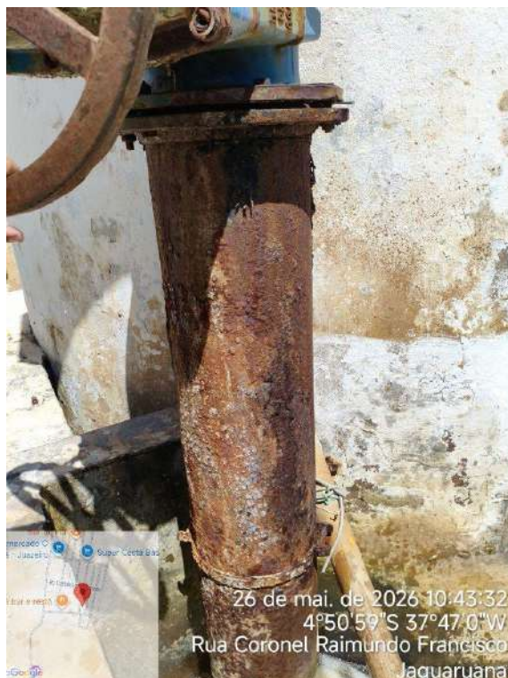
Foto 52 - Filtros: tubulação em processo corrosivo.
