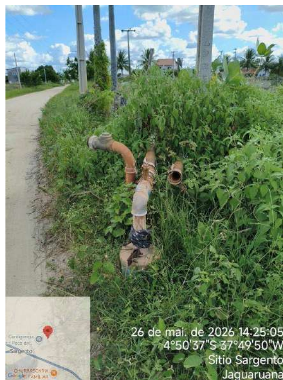
Foto 62 - Poço Tubular: unidade desativada e fora de operação, com sinais de abandono; poço sem isolamento perimetral.
