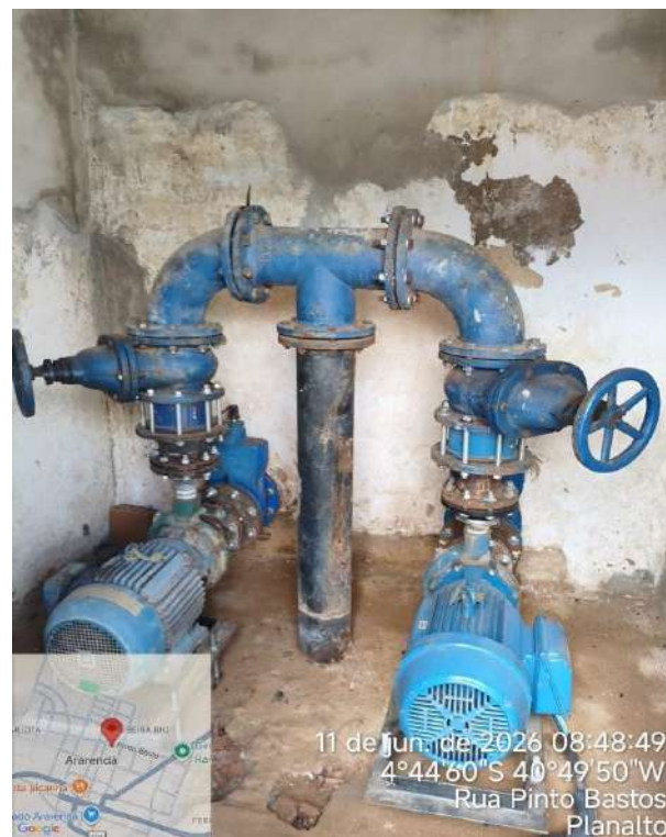
Foto 20 - EEAT-01: equipamentos em base precária, sem fixação.
