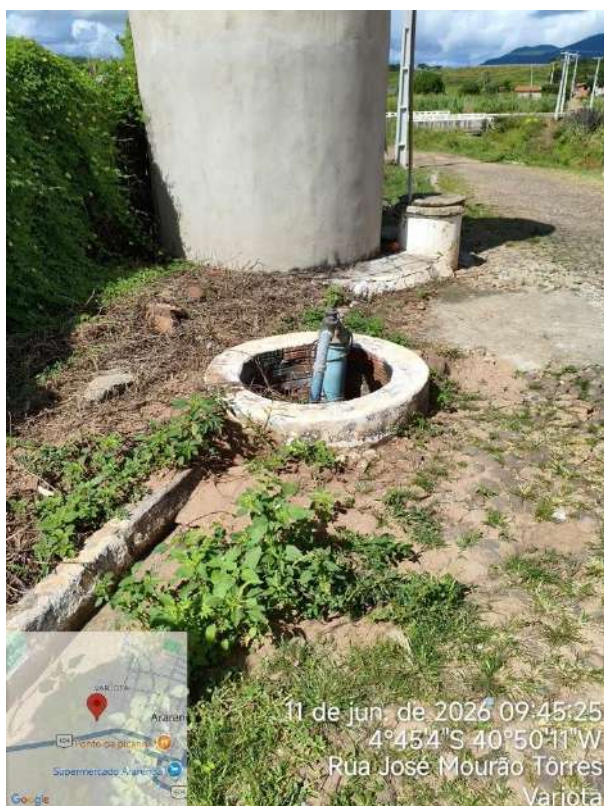
Foto 9 - Poço PT-09: unidade sem isolamento de proteção perimetral e sem identificação.
