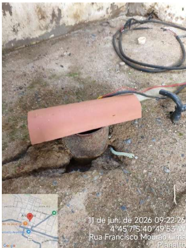
Foto 31 - Poço PT-03: poço sem tamponamento adequado.
