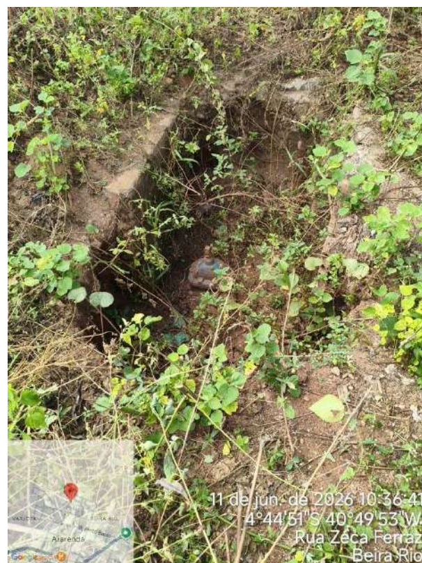
Foto 22 - REL-01: registro sem caixa de proteção.
