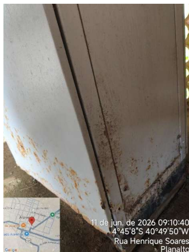
Foto 26 - Poço PT-01: quadro de comando em processo corrosivo.
