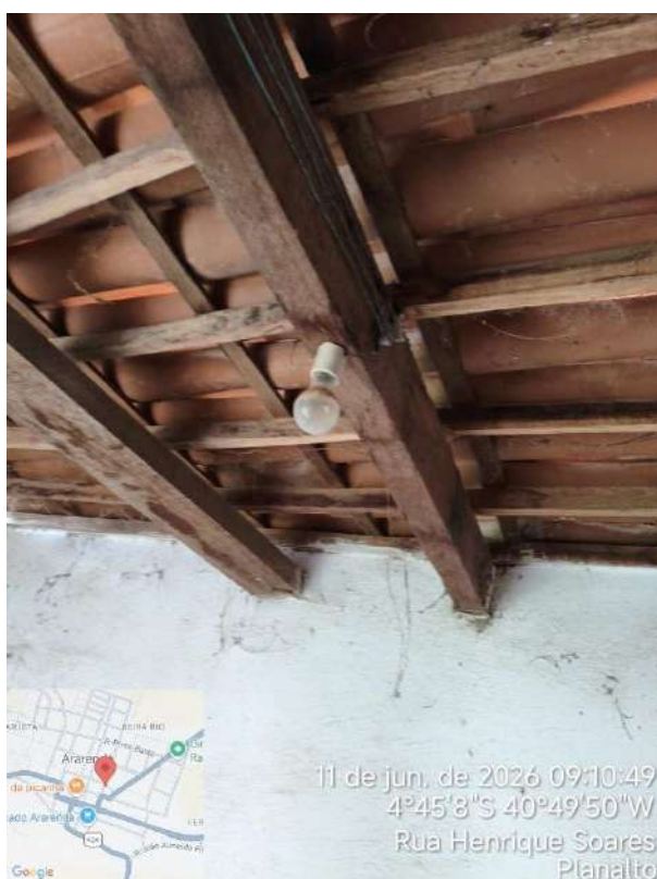
Foto 25 - Poço PT-01: iluminação interna não funcional.
