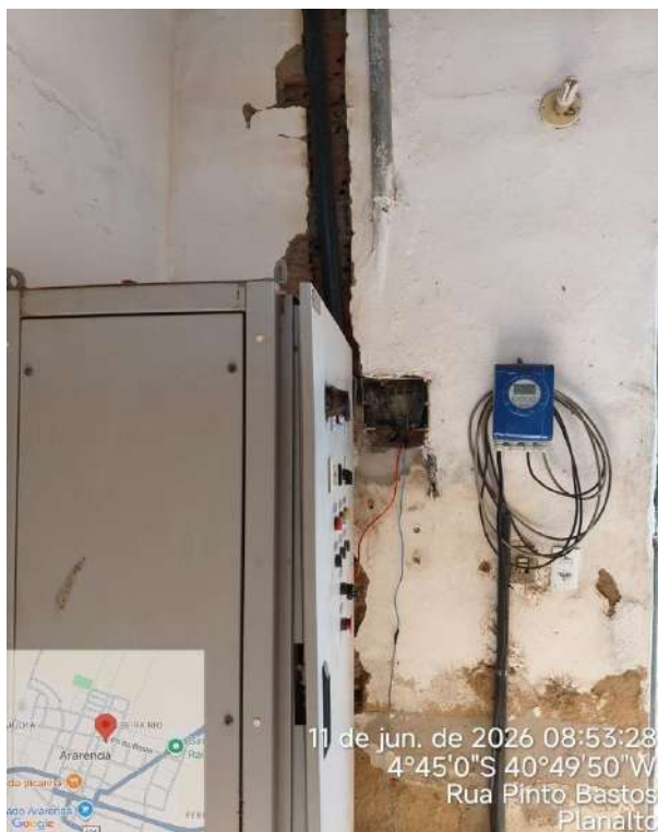
Foto 19 - EEAT-01: instalações elétricas precárias, com quadro sem tampa e cabeamento sem proteção e isolamento.
