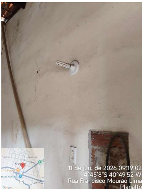
Foto 29 - Poço PT-02: iluminação não funcional.
