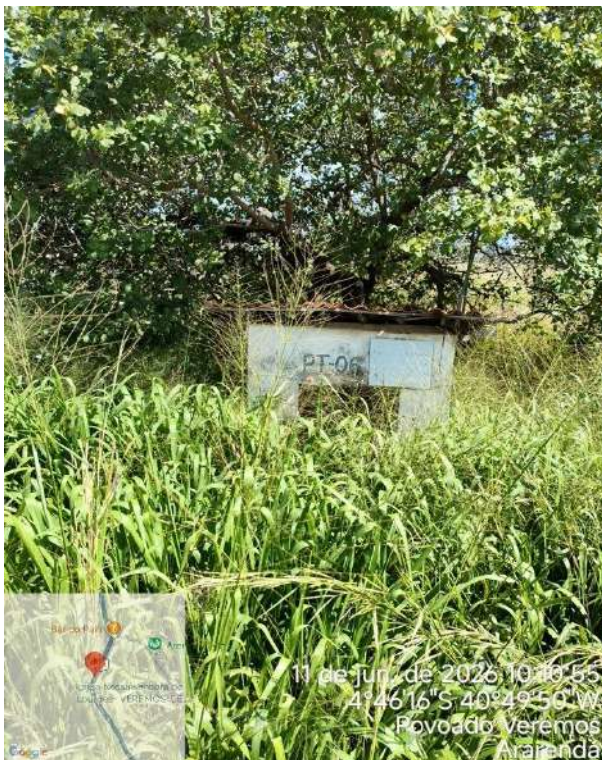
Foto 35 - Poço PT-06: unidade desativada sem desmonte completo, configurando passivo ambiental e de segurança.
