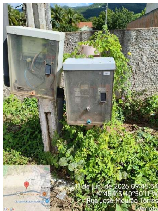
Foto 10 - Poço PT-09: quadros elétricos e vulneráveis.
