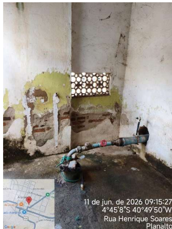
Foto 24 - Poço PT-01: revestimento, piso e pintura interna deteriorados e com sujidades.
