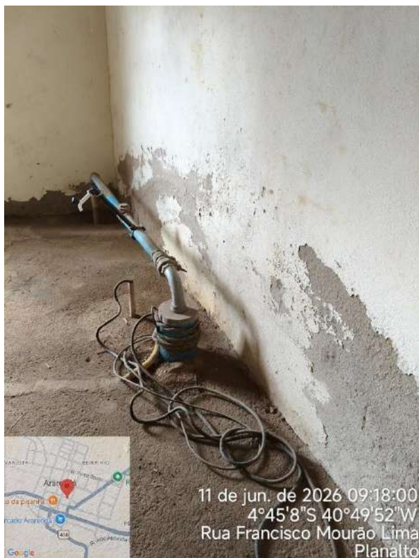
Foto 3 - Poço PT-02: instalações precárias, expostas sobre o piso, sem isolamento e proteção.
