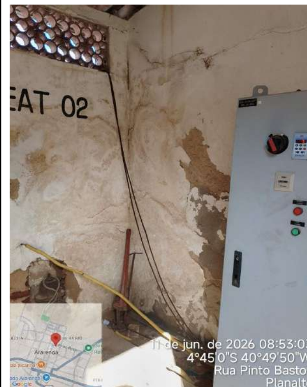
Foto 18 - EEAT-01: instalações elétricas precárias, com cabeamento sem proteção e isolamento, através de cobogós.
