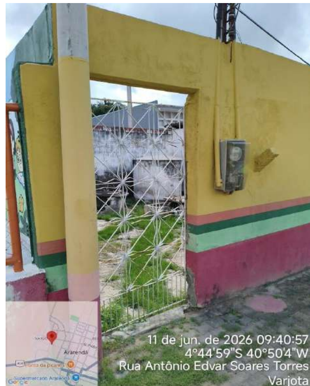
Foto 36 - Poço PT-07: unidade desativada sem desmonte completo, configurando passivo ambiental e de segurança.
