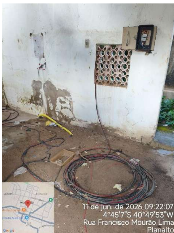
Foto 33 - Poço PT-03: sobras de cabeamento e restos de materiais de descarte na área.
