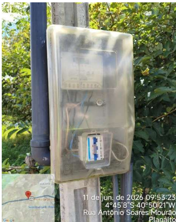
Foto 13 - Poço PT-10 / PT-11: quadro elétrico vulnerável.
