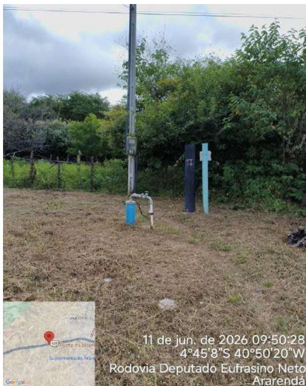
Foto 11- Poço PT-10 / PT-11: unidade sem isolamento de proteção perimetral; sem laje de proteção; sem identificação.
