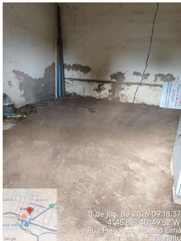
Foto 28 - Poço PT-02: conservação inadequada, com revestimentos, piso e pintura deteriorados e sujidades.
