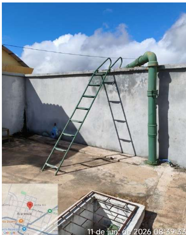
Foto 15 - RAP-01: escada inadequada e sem guarda-corpo na laje de cobertura.
