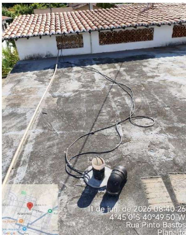
Foto 17 - RAP-01: cabeamento elétrico instalados através do tubo de ventilação, sem eletroduto de proteção e isolamento.
