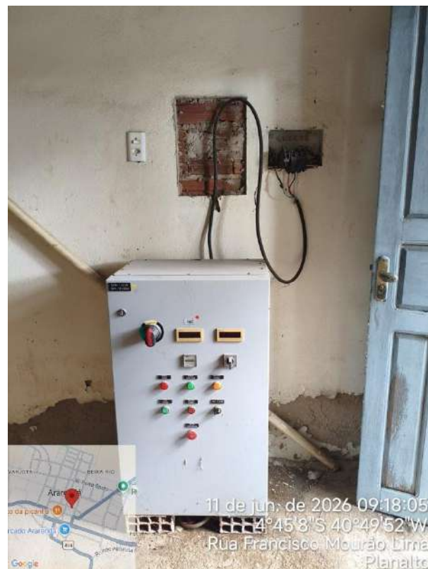
Foto 4 - Poço PT-02: instalações precárias, sem isolamento e proteção; quadro de comando sobre apoios improvisados de tijolos soltos.
