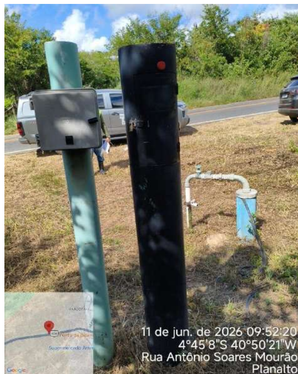
Foto 12 - Poço PT-10 / PT-11: instalações elétricas inadequadas, sobre o solo sem proteção e isolamento.
