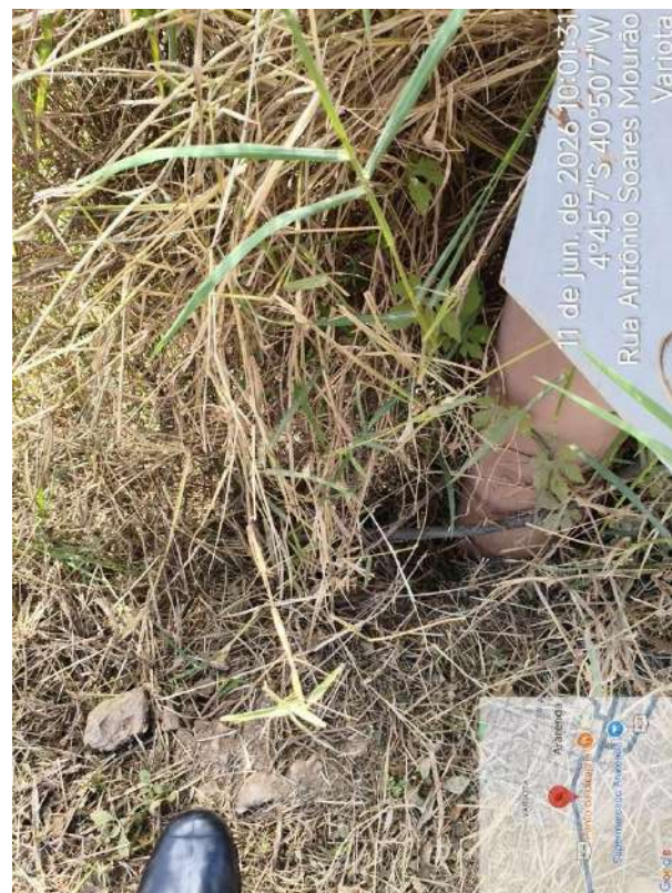
Foto 8 - Poço PT-08: instalações elétricas inadequadas, sobre o solo e sem eletroduto de proteção e isolamento.
