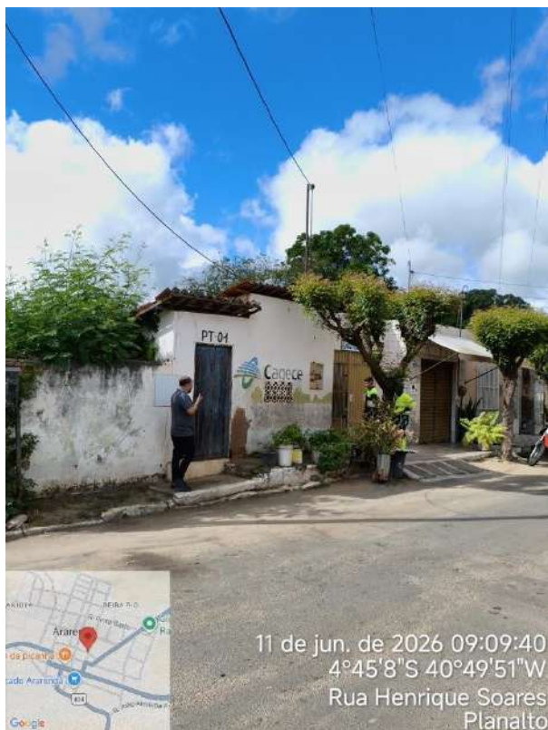
Foto 23 - Poço PT-01: fachada com revestimento e pintura deteriorados.
