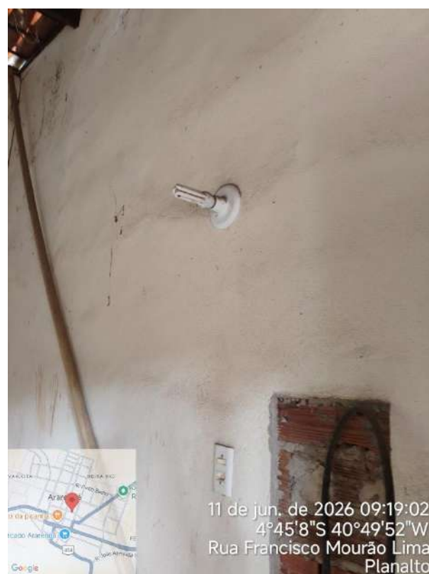
Foto 34 - Poço PT-03: iluminação não funcional.
