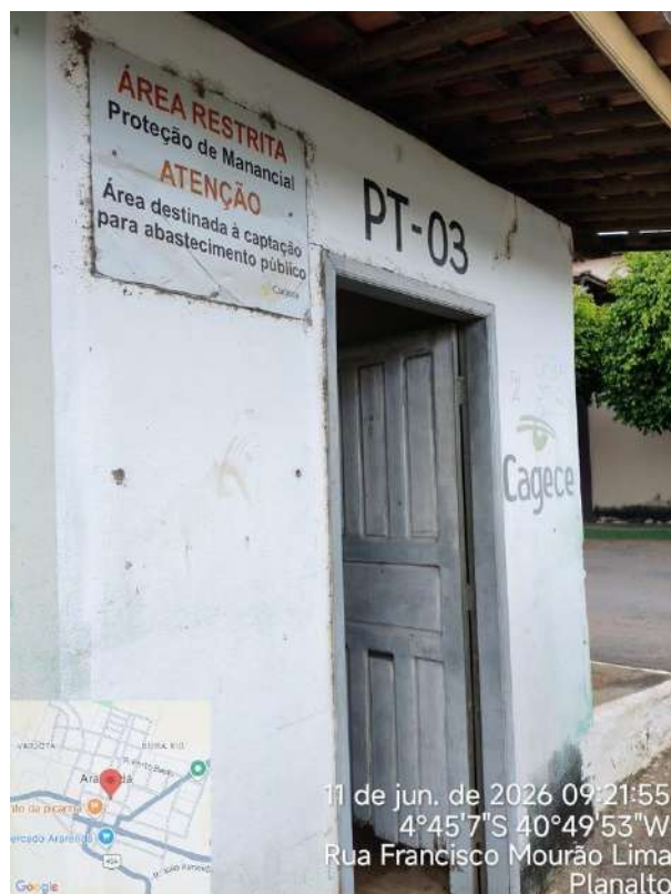
Foto 30 - Poço PT-03: porta de acesso danificada.
