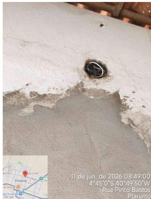
Foto 38 - REL-01: iluminação não funcional.
