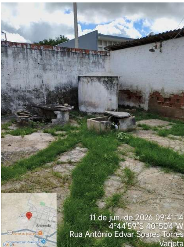
Foto 37 - Poço PT-07: unidade desativada sem desmonte completo, configurando passivo ambiental e de segurança.
