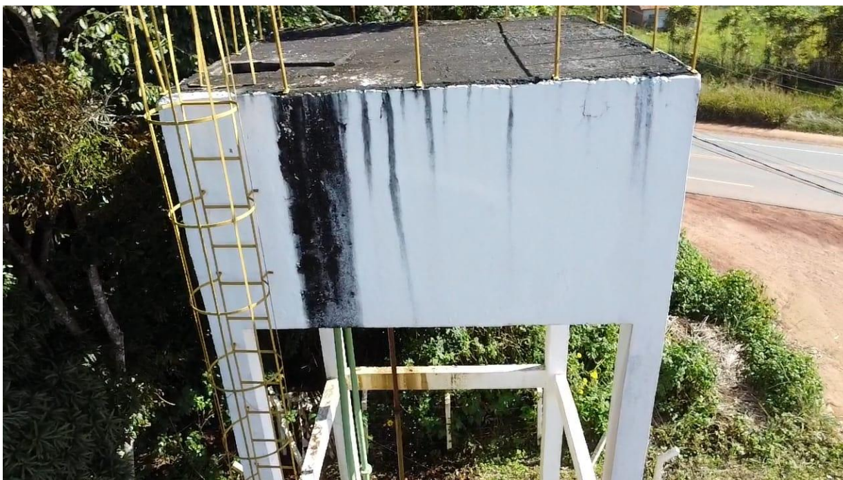
Foto 9 - REL-17 (Pituba): vazamento na tubulação e na lateral do reservatório.
