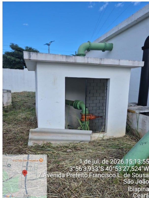
Foto 5 - Booster (Sede): danos no portão de acesso.
