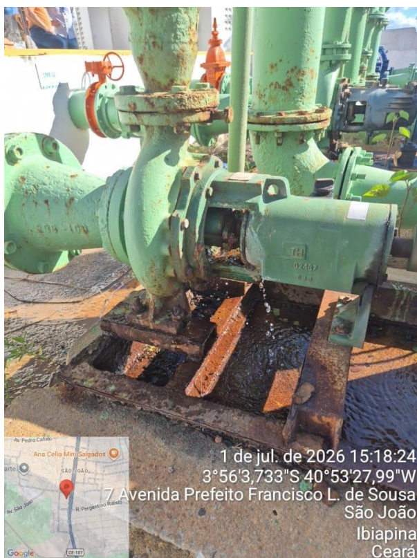
Foto 2 - EEAT-05 (Sede): vazamento em todas as unidades dos conjuntos motobombas.
