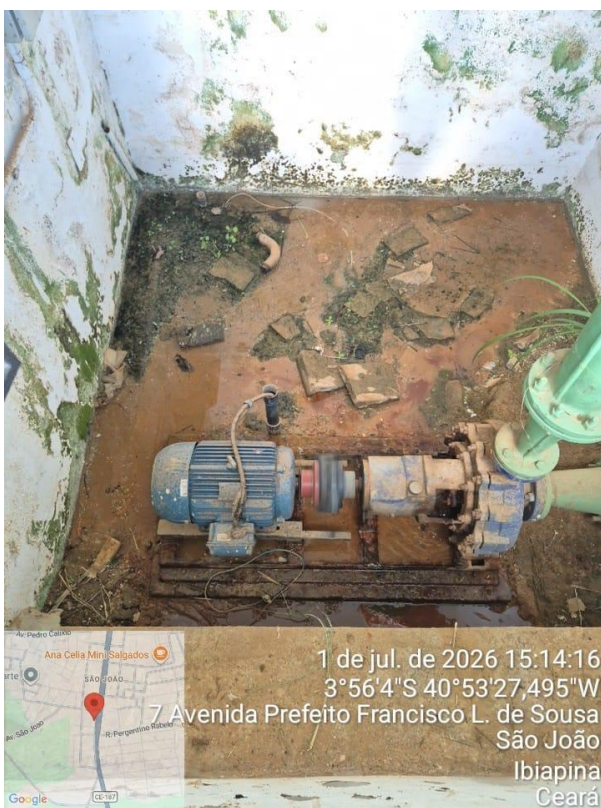
Foto 6 - Booster (Sede): vazamentos nas instalações.
