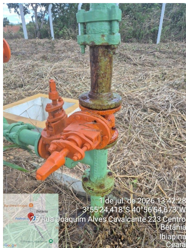
Foto 7 - REL-12 (Betânia): vazamento na tubulação.
