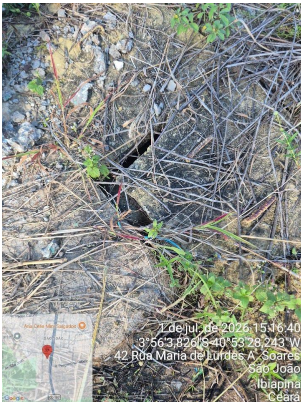
Foto 4 - Pátio (Sede): caixa com tampa danificada e fiação exposta.
