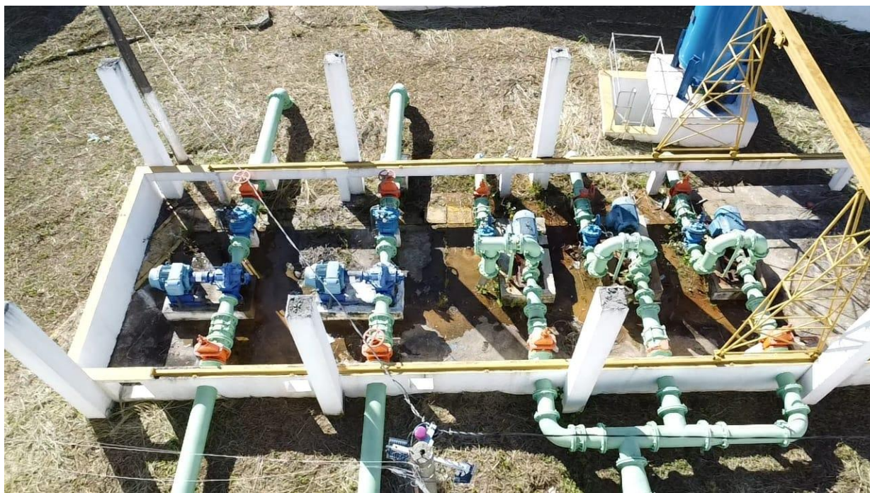
Foto 1 - EEAT-05 (Sede): vazamento em todas as unidades dos conjuntos motobombas.
