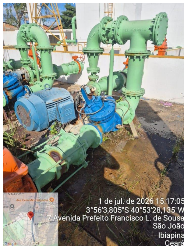
Foto 3 - EEAT-05 (Sede): vazamento em todas as unidades dos conjuntos motobombas.
