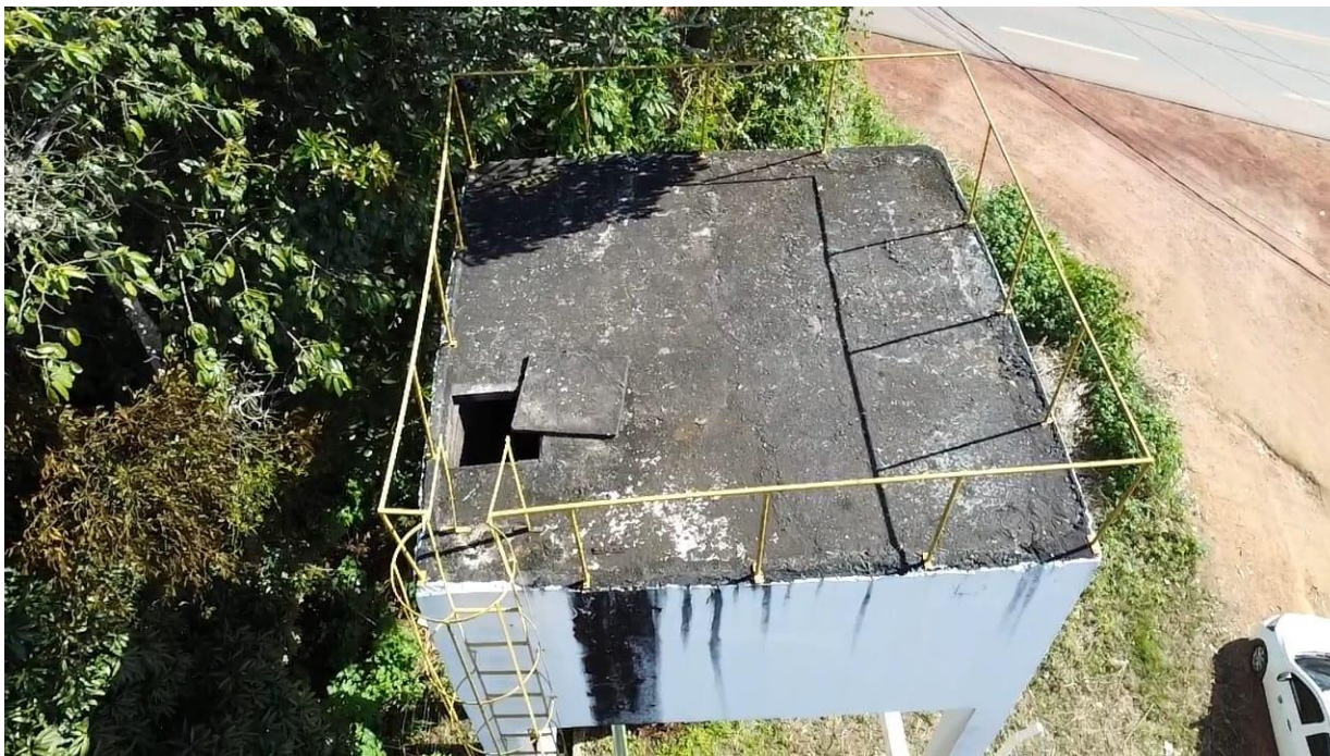
Foto 8 - REL-17 (Pituba): tampa na abertura de inspeção deslocada.
