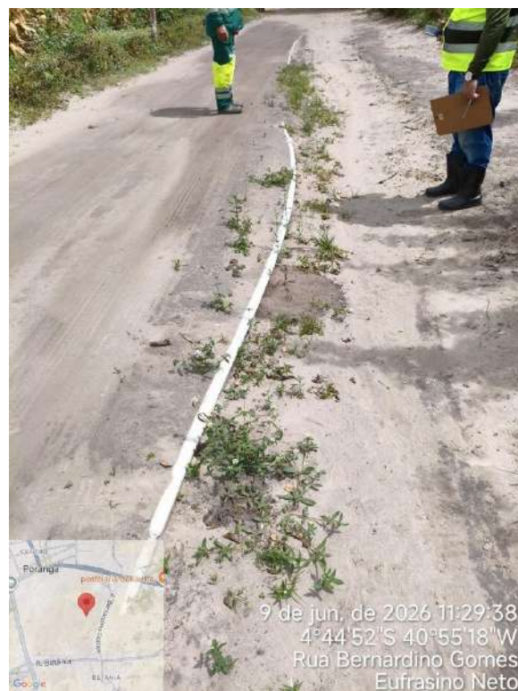
Foto 6 - Pátio: adutora exposta na área de circulação.
