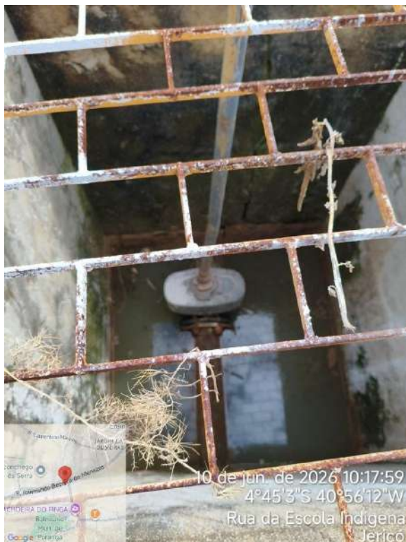
Foto 89 - EEE-01: caixa de registro inundada.
