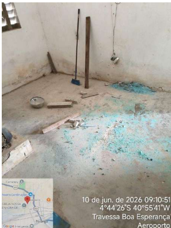
Foto 79 - EEAT-04: área com sujeira.
