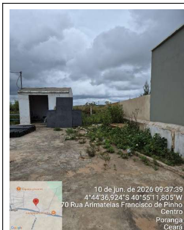
Foto 101 - ETE: no local da casa de química desativada funciona uma elevatória.
