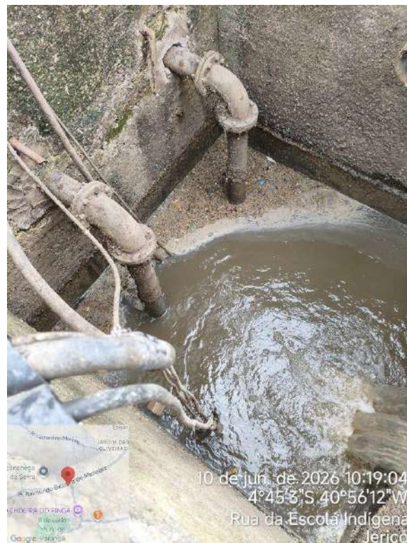
Foto 90 - EEE-01: tanque de sucção com presença de material sobrenadante.
