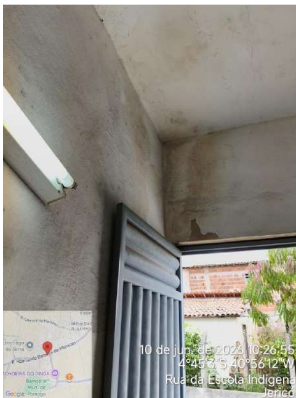
Foto 93 - EEE-01: pintura deteriorada.
