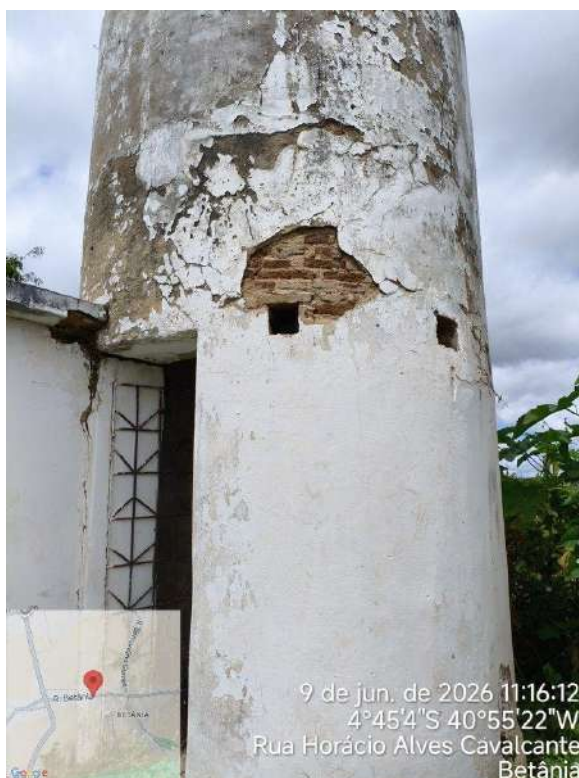
Foto 63 - PT-01: casa do quadro de comando deteriorada, pintura e reboco deteriorados; presença de vespeiro.
