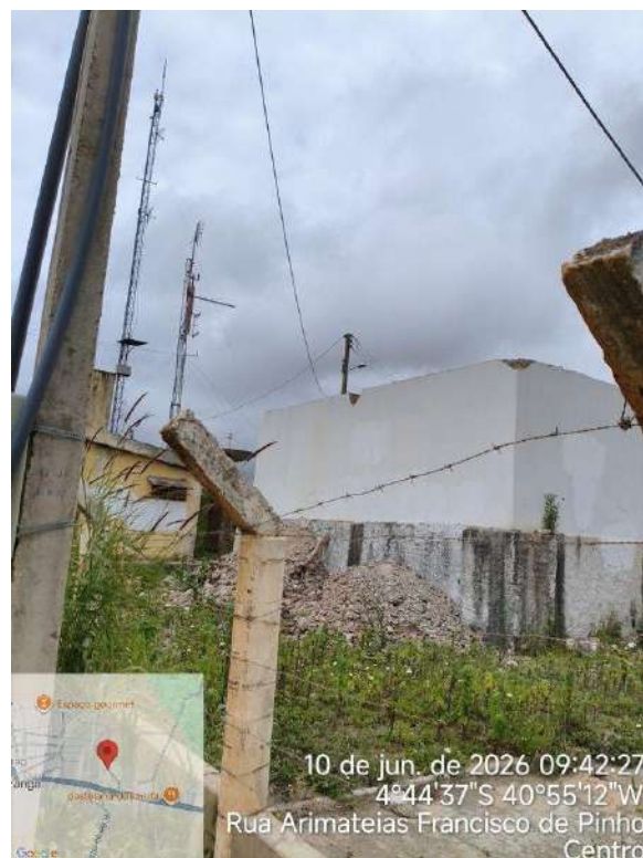
Foto 86 - RAP-01: cerca danificada.
