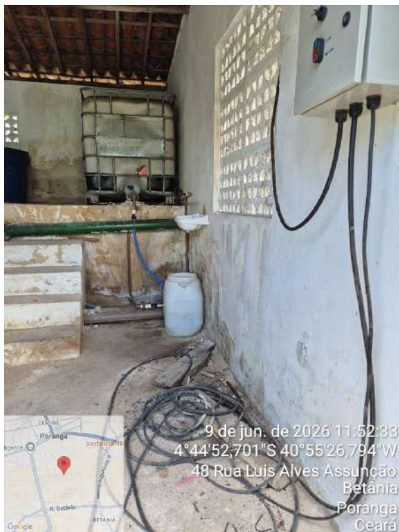
Foto 25 - Depósito / Casa de Química: cabeamento exposto sobre o piso, sem isolamento de proteção.
