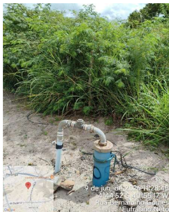
Foto 8 - PT-05: unidade desprovida de laje de proteção; sem identificação visível; cabeamento exposto sobre o solo, sem isolamento de proteção.
