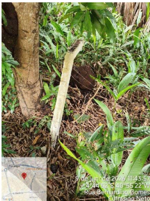
Foto 67 - Pátio: Cerca de isolamento danificada.
