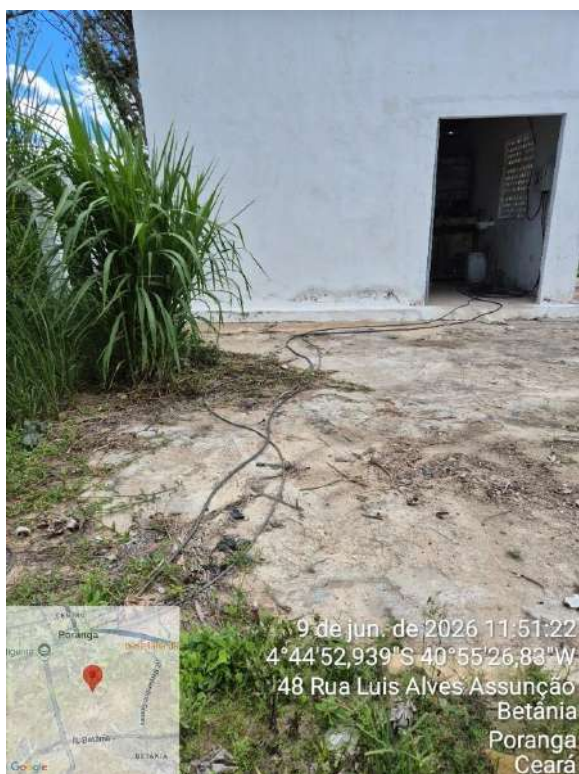
Foto 23 - Depósito / Casa de Química: sem identificação; cabeamento exposto, através de vão de porta, sem isolamento de proteção.
