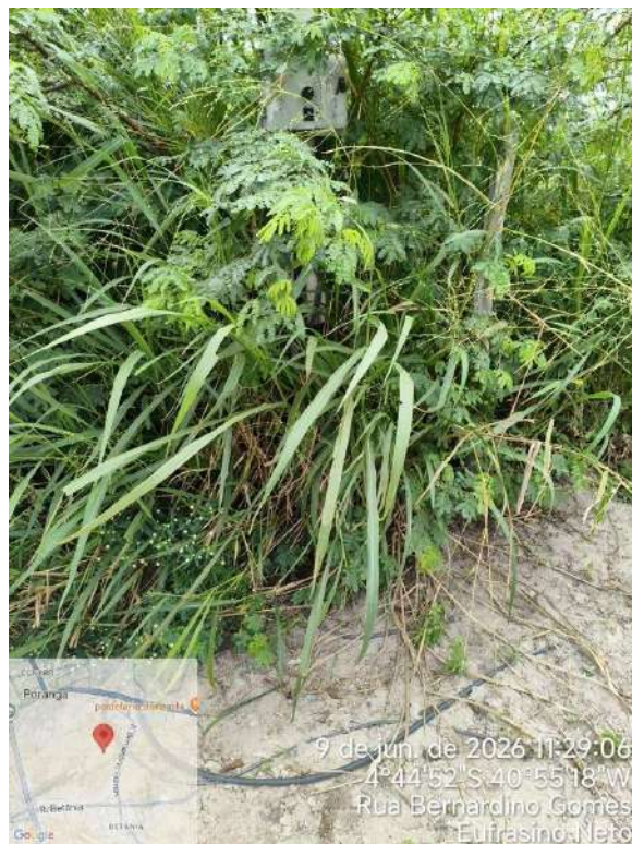
Foto 66 - PT-05: quadro de comando em área de vegetação densa.
