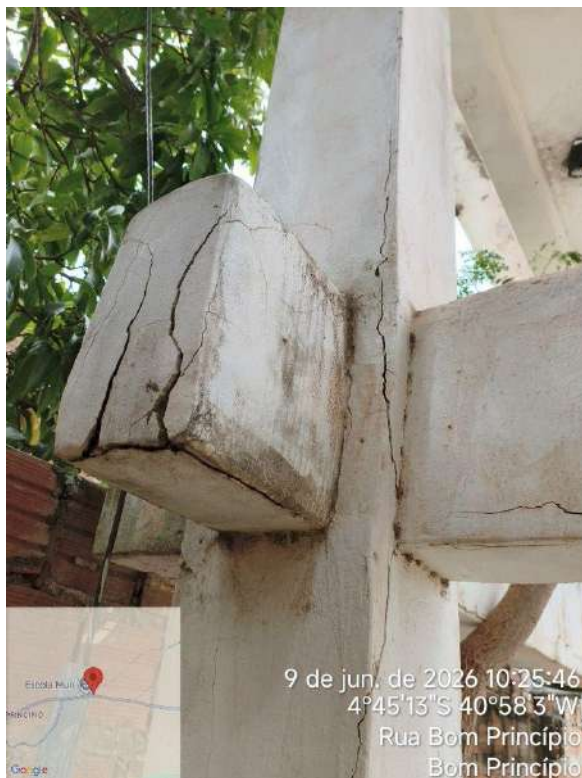
Foto 73 - REL-03: pintura deteriorada; rachaduras/fissuras na estrutura.
