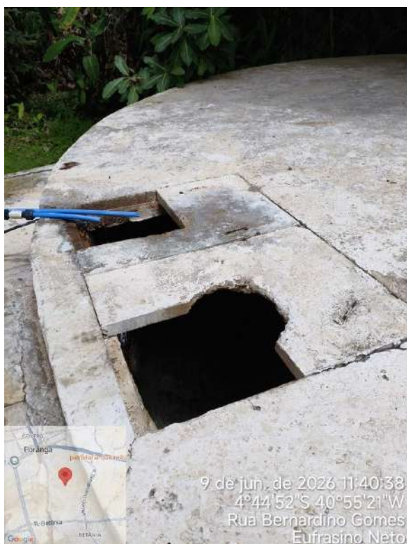
Foto 15 - PA-01: tampas incompletas; tubulações e cabeamento conduzidos através da abertura de inspeção; instalações elétricas sem isolamento de proteção.
