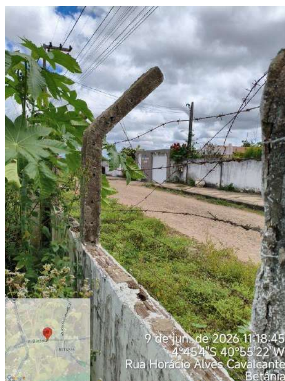
Foto 60 - PT-01: isolamento perimetral com pintura e cerca deteriorada.
