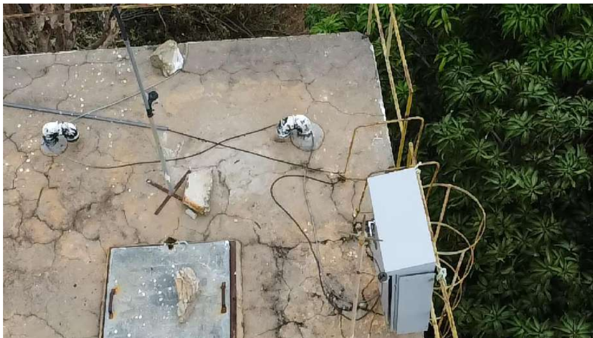
Foto 44 - REL-03: escada incompleta; fios/cabos sem eletroduto de proteção e isolamento; laje de cobertura com rachaduras.
