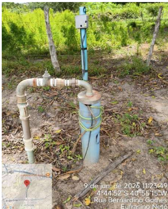
Foto 9 - PT-06: unidade desprovida de laje de proteção; sem identificação visível; cabeamento exposto sobre o solo, sem isolamento de proteção.
