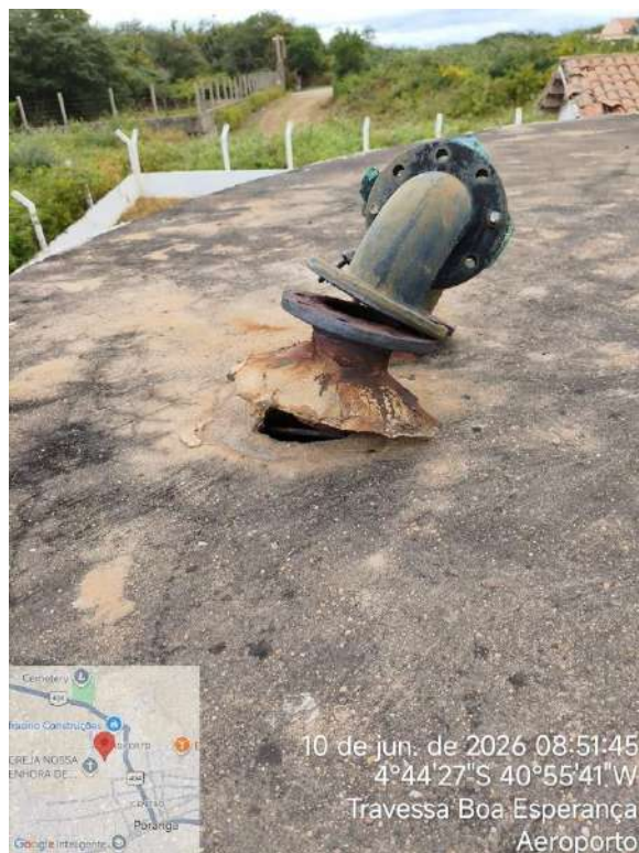
Foto 76 - RAP-02: tubo de ventilação danificado.
