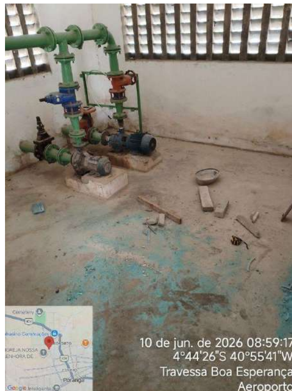
Foto 78 - EEAT-04: área com sujeira.
