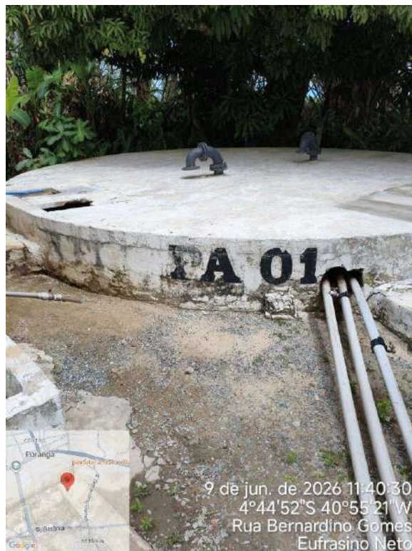
Foto 14 - PA-01: aberturas de inspeção com tampas incompletas; buraco de entrada de tubulação sem acabamento.
