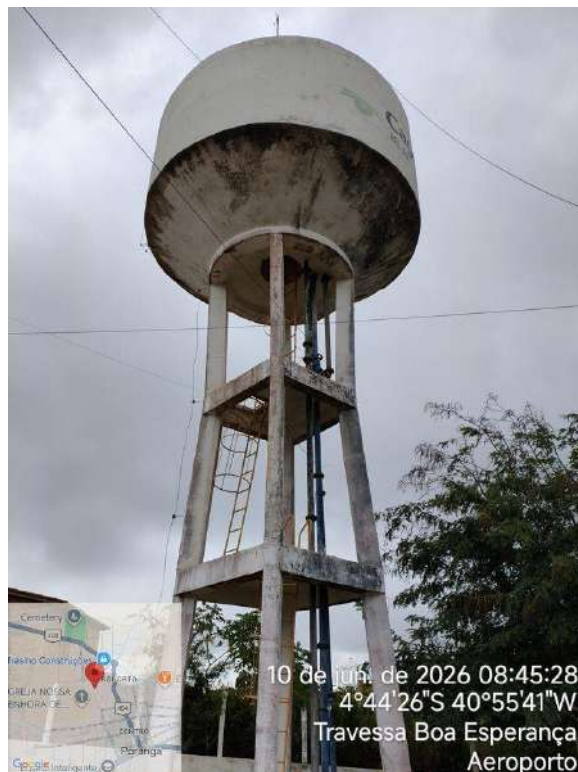
Foto 38 - REL-02: Sem grades de proteção nas plataformas e laje de cobertura.
