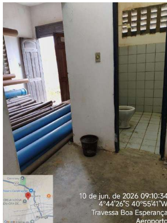
Foto 80 - EEAT-04: materiais armazenados de forma inadequada, obstruindo a área de circulação.
