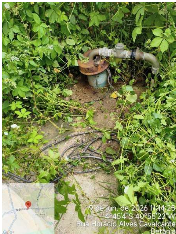
Foto 1 - PT-01: Cabeamento exposto sobre o solo, sem isolamento de proteção; vegetação crescida.
