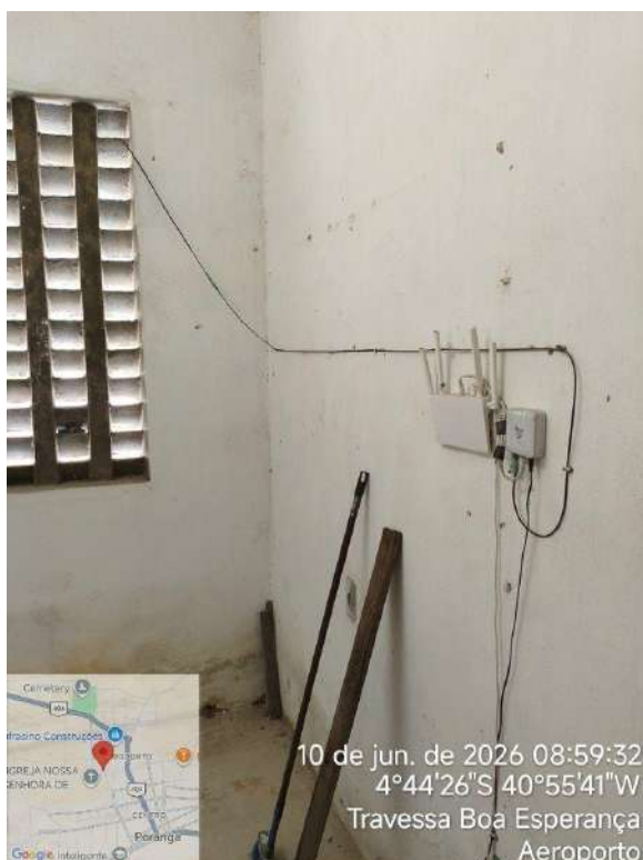
Foto 42 - EEAT-04: fios/cabos expostos, instalados através de cobogós, sem isolamento de proteção.
