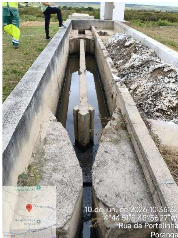
Foto 56 - ETE: tratamento preliminar sem comportas (stops box) de operação e manutenção das caixas de areia.
