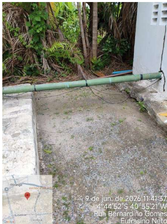
Foto 18 - EEAT-02: instalações elétricas sem isolamento de proteção.
