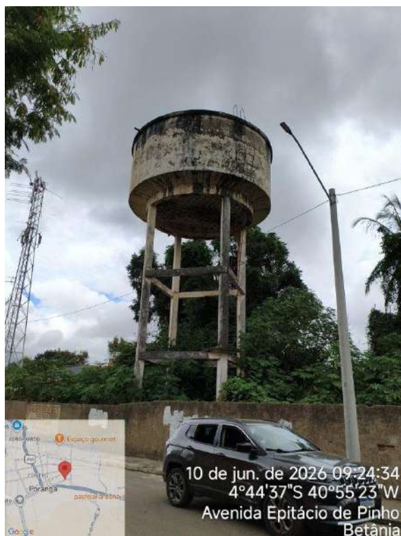
Foto 81 - REL-01: Unidade desativada em situação de abandono, apresentando patologias estruturais em local com vegetação densa.
