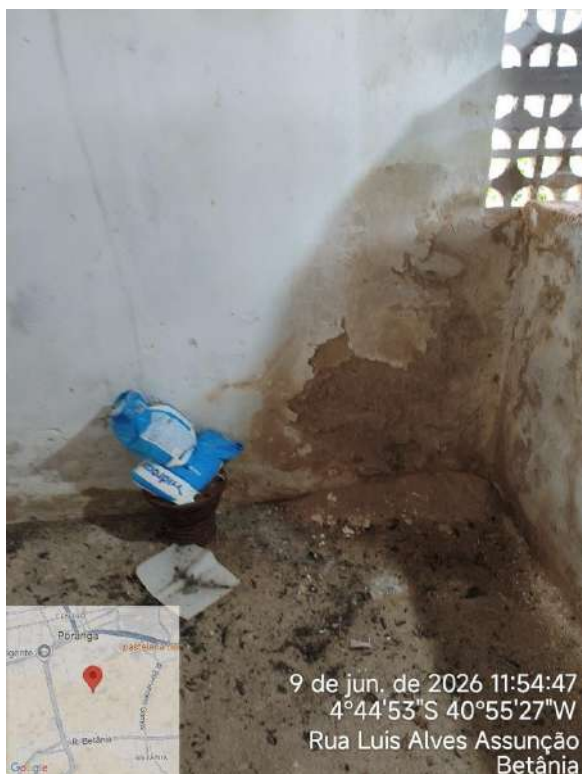
Foto 69 - ETA-02: presença de sujidades na área do depósito e casa de química..
