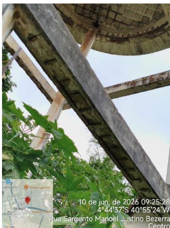
Foto 83 - REL-01: Unidade desativada em situação de abandono, apresentando patologias estruturais e vegetação densa.
