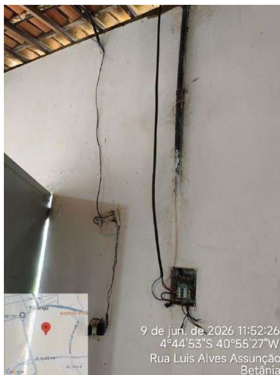
Foto 24 - Depósito / Casa de Química: quadro elétrico sem tampa e cabeamento exposto sem isolamento de proteção.
