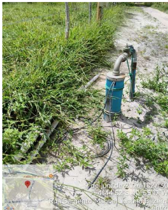
Foto 10 - PT-10: unidade desprovida de laje de proteção; sem identificação visível; cabeamento exposto sobre o solo, sem isolamento de proteção.
