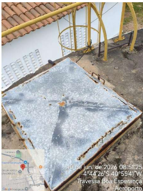
Foto 40 - RAP-02: cabeamento elétrico preso à estrutura da escada e implementado através da abertura de inspeção.
