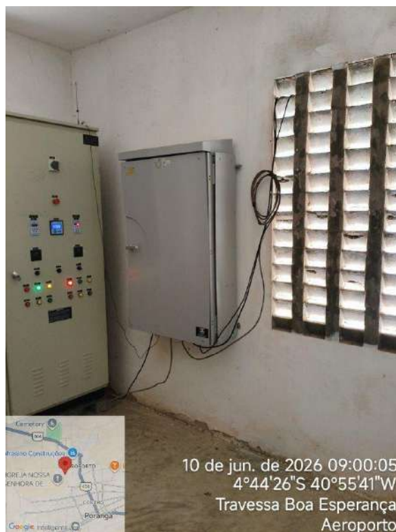
Foto 41 - EEAT-04: fios/cabos expostos, instalados através de cobogós, sem isolamento de proteção.
