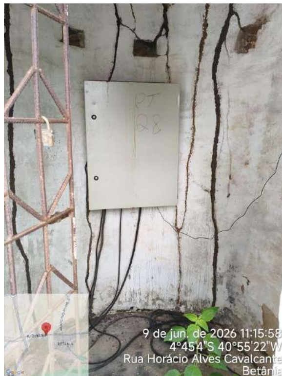
Foto 2 - PT-01: Cabeamento exposto sobre o piso, sem isolamento de proteção.
