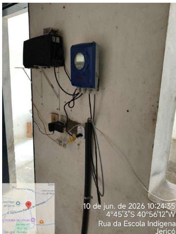
Foto 51 - EEE-01: instalações elétricas precárias sem isolamento de proteção e conduzidas através de vão de porta.
