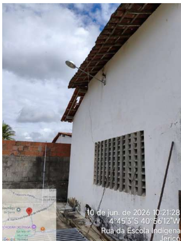
Foto 53 - EEE-01: instalações elétricas precárias, conduzidas através de cobogós.
