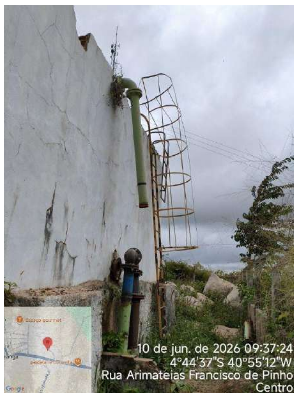
Foto 85 - RAP-01: unidade em obras de recuperação, apresentando ruína da laje e escada danificada.
