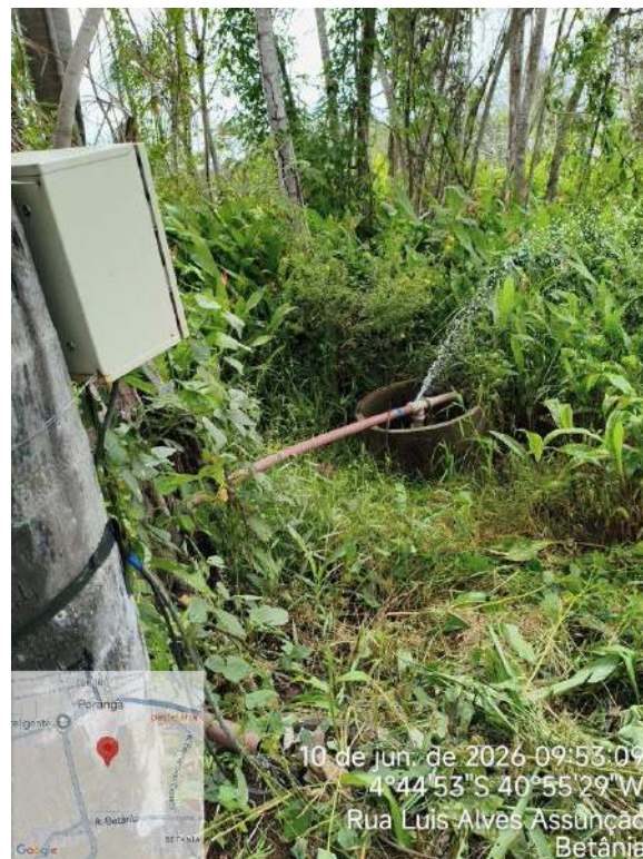
Foto 48 - PA-03: fios/cabos sem eletrodutos de proteção e isolamento e vazamento na adutora do poço.
