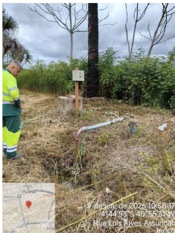
Foto 4 - PT-04: Desprovido de proteção, de identificação e de laje de proteção.
