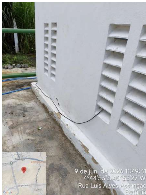
Foto 30 - EEAT-03: cabearamento sem isolamento de proteção, instalado através de cobogós.
