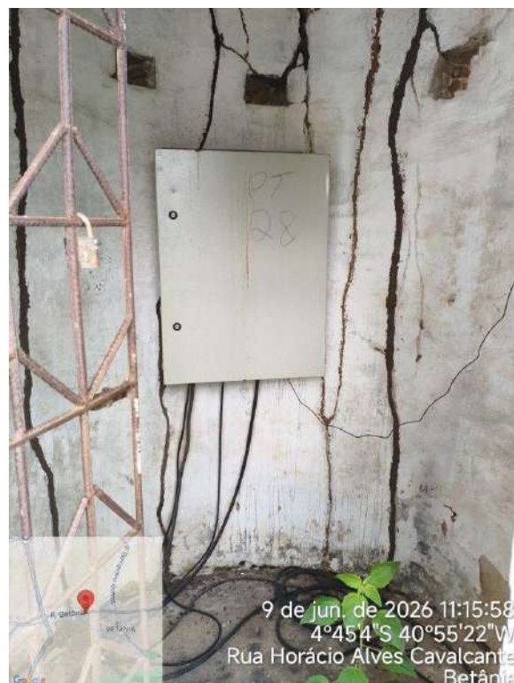
Foto 62 - PT-01: casa do quadro de comando deteriorada, com presença de cupim, pintura e reboco deteriorados.
