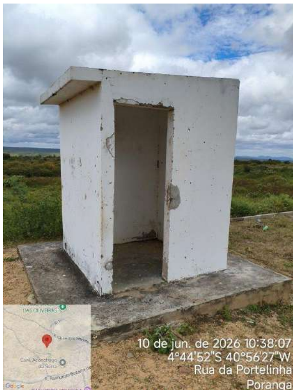
Foto 55 - ETE: infraestrutura de apoio ao operador precária; sem banheiro e água disponível; sem energia elétrica e iluminação.
