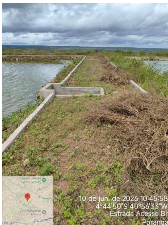
Foto 58 - ETE: caixa desprovida de tampa na área de circulação dos taludes.
