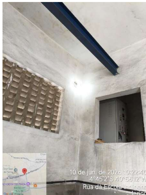
Foto 92 - EEE-01: pintura deteriorada.
