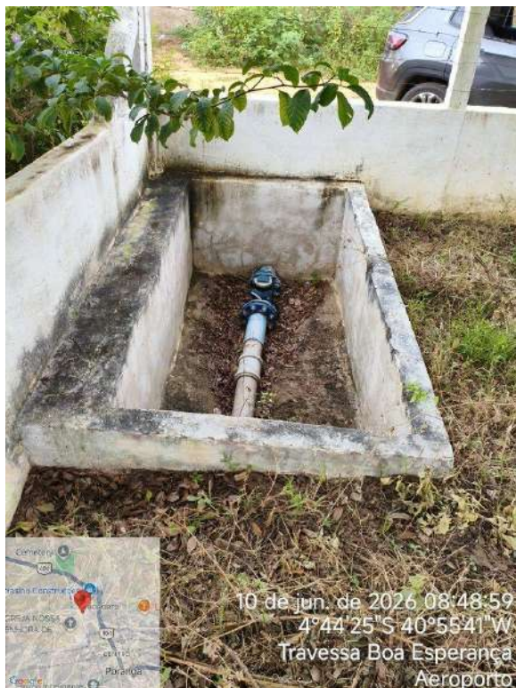
Foto 37 - Pátio: caixa de macromedicação desprovida de tampa e de grade de proteção.
