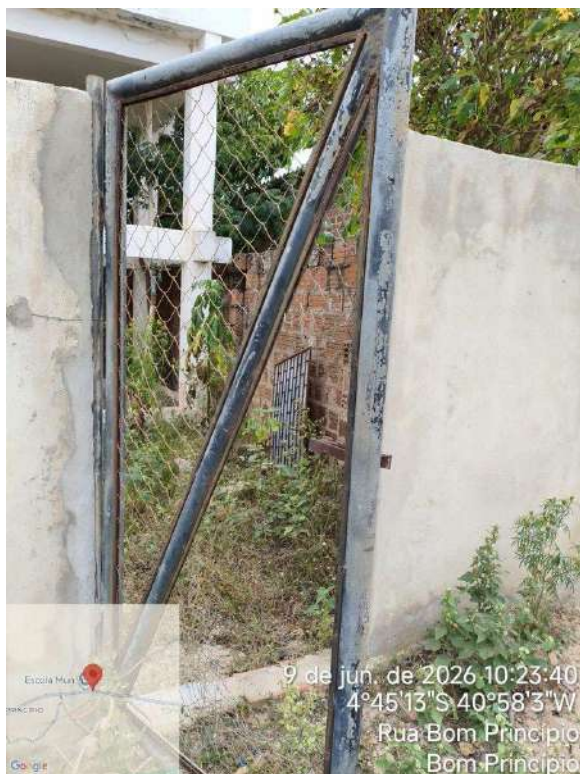
Foto 45 - REL-03: Portão de entrada desprovido de tranca e muro de proteção sem acabamento.
