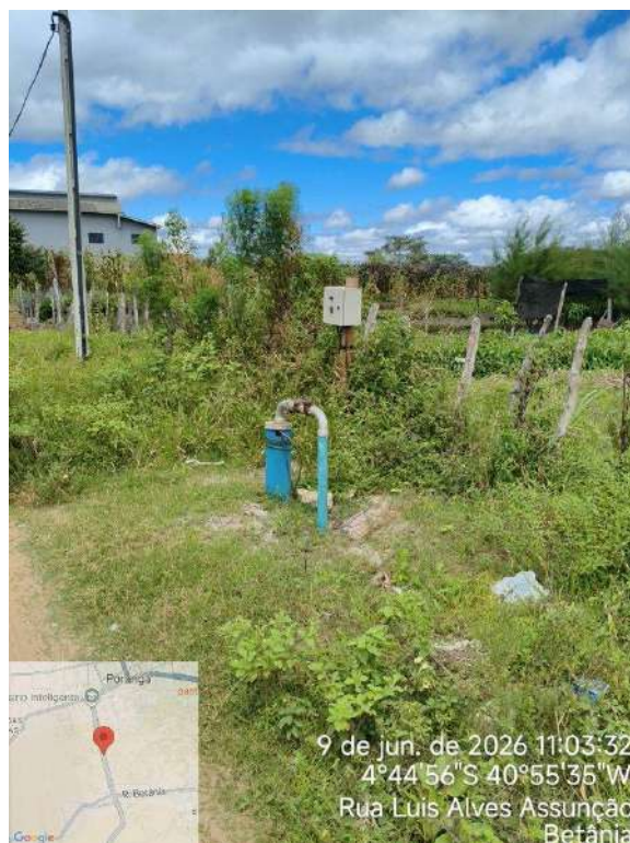
Foto 12 - PT-11: totalmente exposta à margem da via, desprovida de proteção, de identificação e de laje de proteção.
