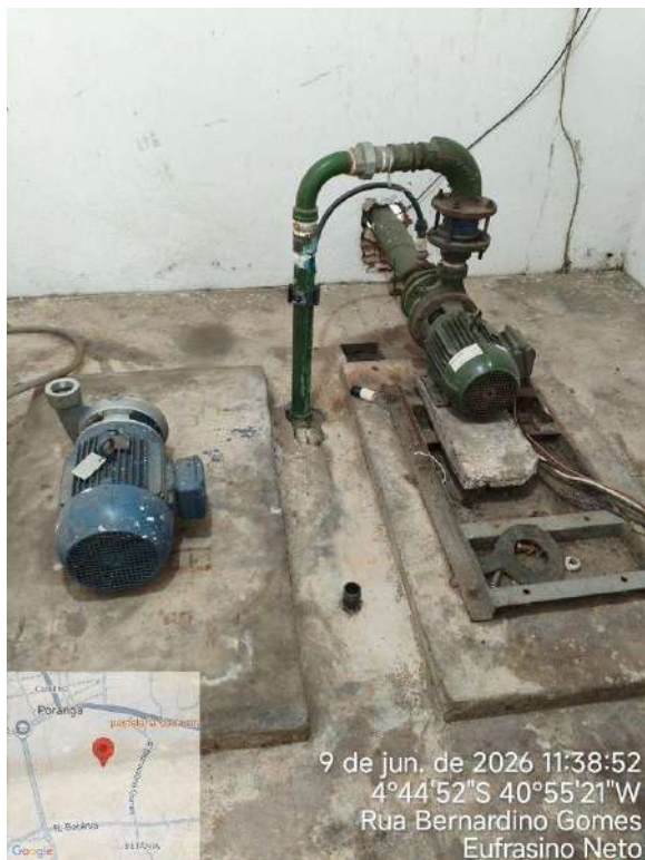
Foto 21 - EEAT-02: Conjunto motobomba instalado sobre base improvisada e instalações precárias.
