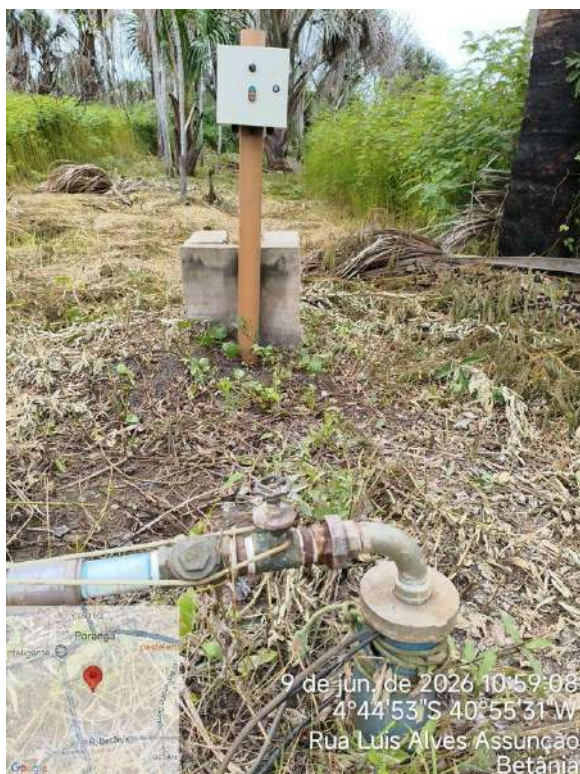
Foto 5 - PT-04: Cabeamento exposto sobre o solo, sem isolamento de proteção.
