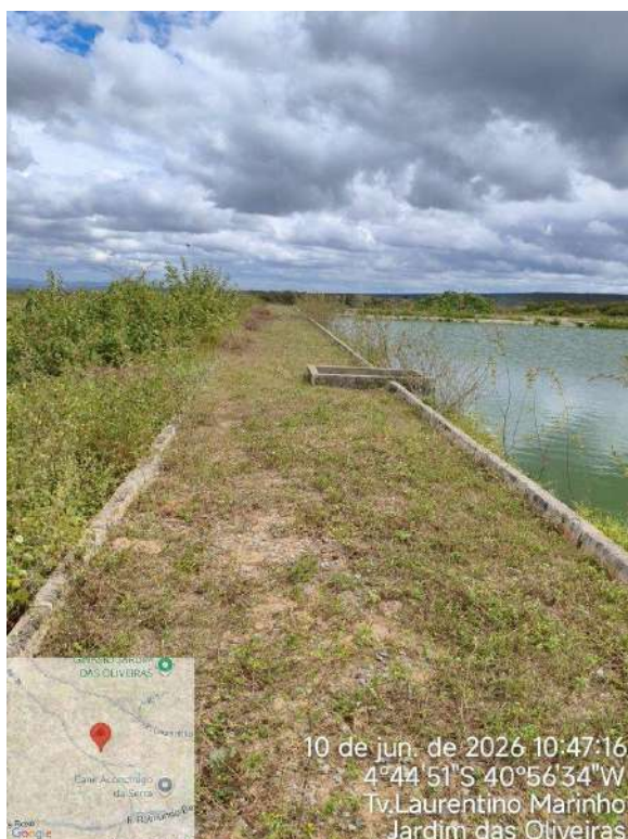
Foto 57 - ETE: caixa desprovida de tampa na área de circulação dos taludes.
