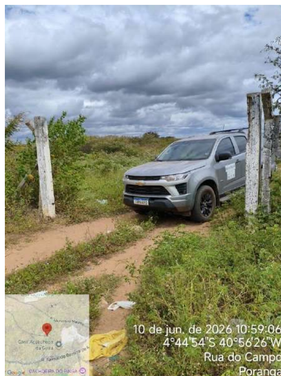
Foto 54 - ETE: Vão de acesso a ETE sem portão.
