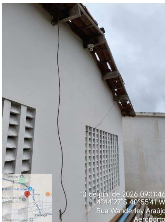
Foto 43 - EEAT-04: fios/cabos expostos, instalados através de cobogós, sem isolamento de proteção.
