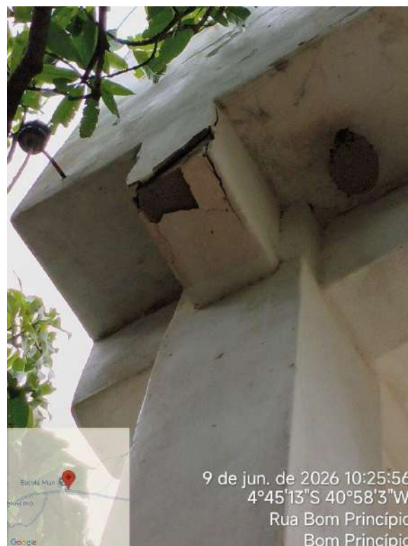
Foto 72 - REL-03: pintura deteriorada; rachaduras/fissuras na estrutura
