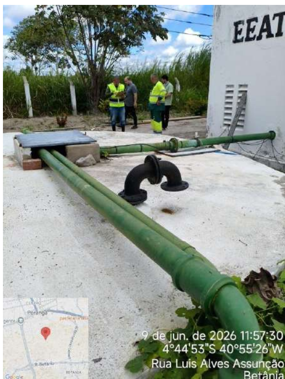
Foto 27 - PA-02: tampa sem fecho hermético; instalações hidráulicas e elétricas inadequadas, através das aberturas de inspeção.
