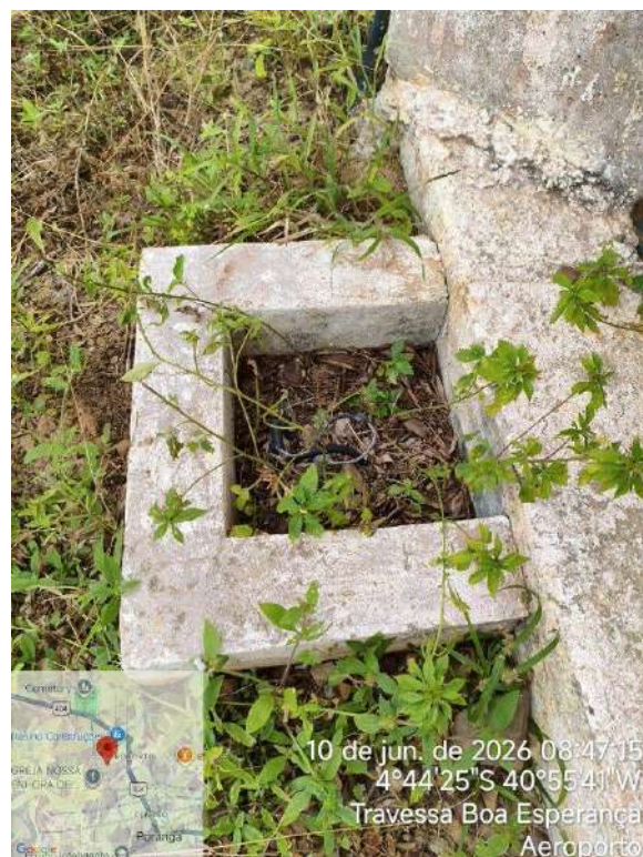
Foto 36 - Pátio: caixa de passagem elétrica desprovida de tampa, com fiação exposta;
