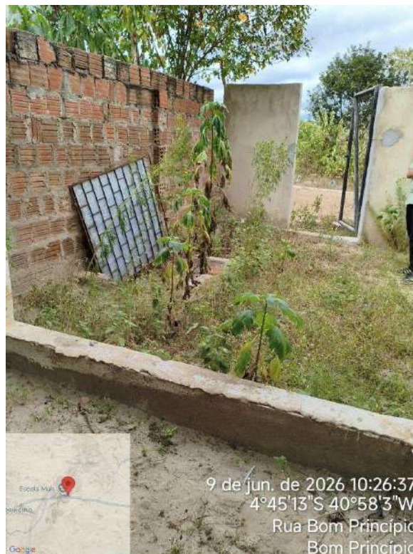
Foto 74 - REL-03: portão de entrada danificado.
