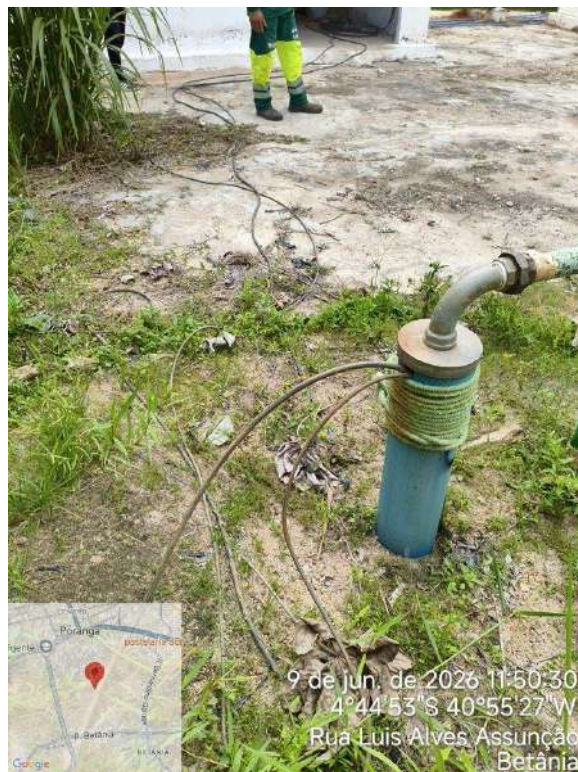
Foto 22 - PT-07: sem laje de proteção; cabeamento sobre o solo/piso, através de vão de porta, sem isolamento de proteção.
