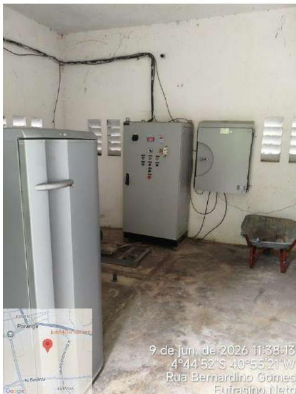
Foto 19 - EEAT-02: instalações elétricas sem isolamento de proteção.
