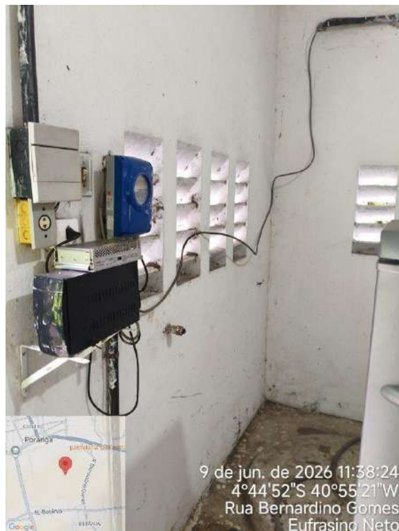
Foto 20 - EEAT-02: instalações elétricas sem isolamento de proteção.
