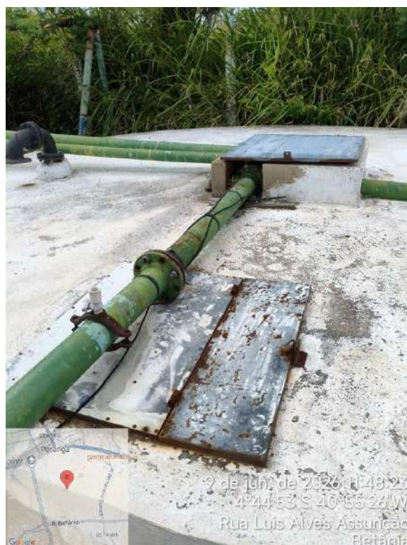
Foto 28 - PA-02: tampa sem fecho hermético; instalações hidráulicas e elétricas inadequadas, através das aberturas de inspeção.
