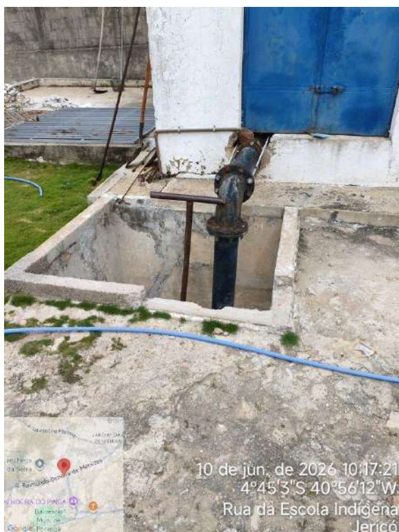
Foto 49 - EEE-01: caixa no pátio desprovida de tampa de proteção
