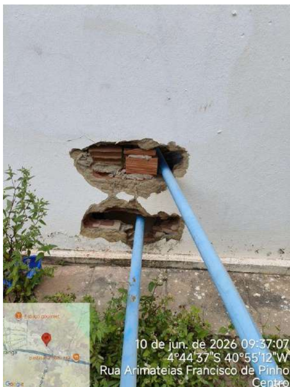
Foto 33 - RAP-01: tubulação passando por buraco sem acabamento.
