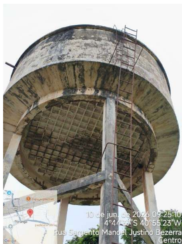
Foto 84 - REL-01: Unidade desativada em situação de abandono, apresentando patologias estruturais.
