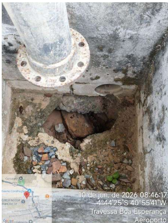
Foto 75 - REL-02: Caixa de descarga com fundo em processo avançado de erosão.
