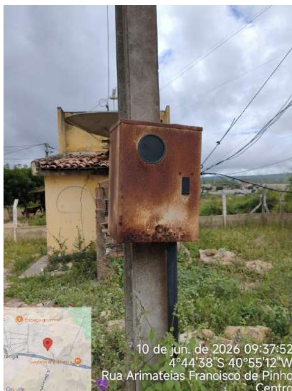
Foto 87 - RAP-01: quadro elétrico corroído.
