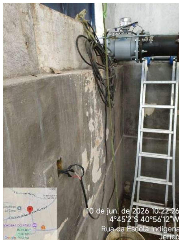
Foto 52 - EEE-01: instalações elétricas precárias, conduzidas através de cobogós, sem isolamento de proteção.
