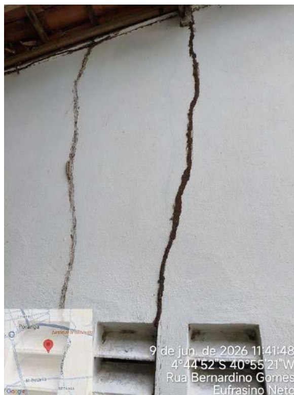
Foto 68 - EEAT-02: presença de cupim nas paredes.
