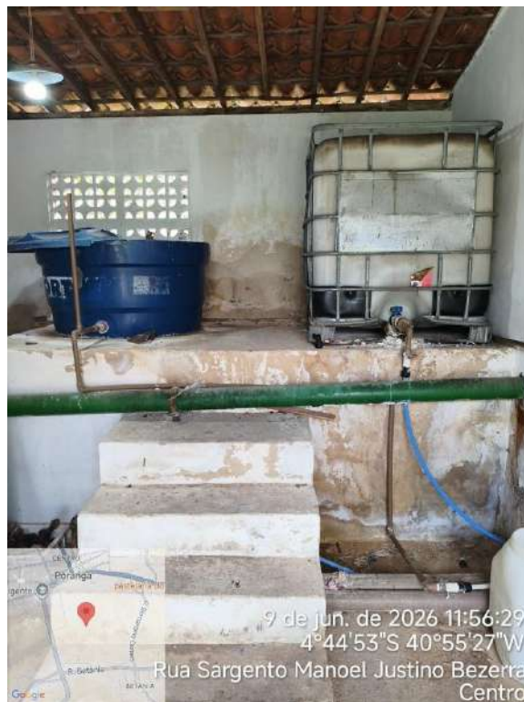
Foto 26 - Depósito / Casa de Química: escada e plataforma sem corrimão / grades de proteção; casa de química não aparece no croqui.
