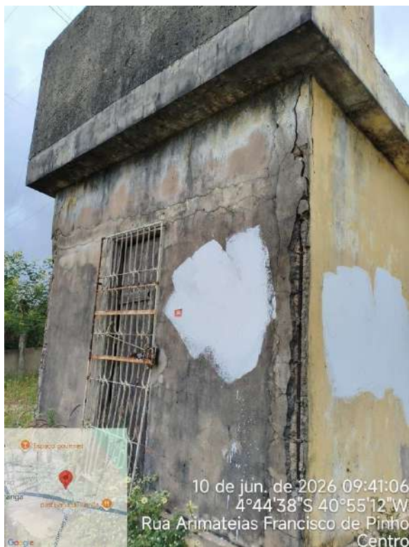
Foto 105 - RAP-01: prédio anexo (abrigo da antena da Prefeitura) com anomalias estruturais.
