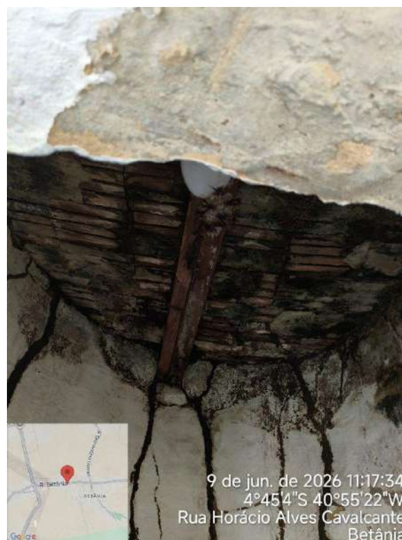
Foto 64 - PT-01: casa do quadro de comando deteriorada, pintura e reboco deteriorados.
