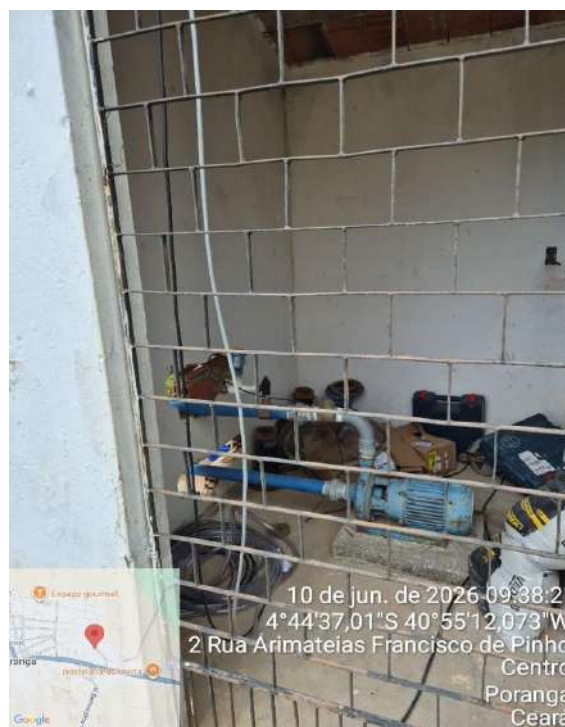
Foto 102 - ETE: no local da casa de química desativada funciona uma elevatória.
