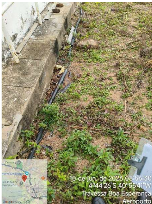
Foto 77 - EEAT-04: Instalações elétricas danificadas, com fios e cabos expostos.
