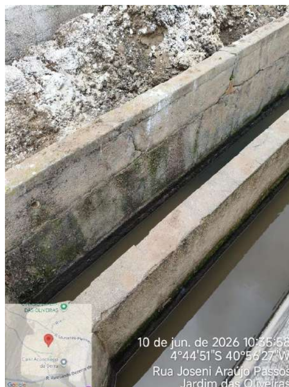
Foto 96 - ETE: caixa de areia com estrutura danificada.
