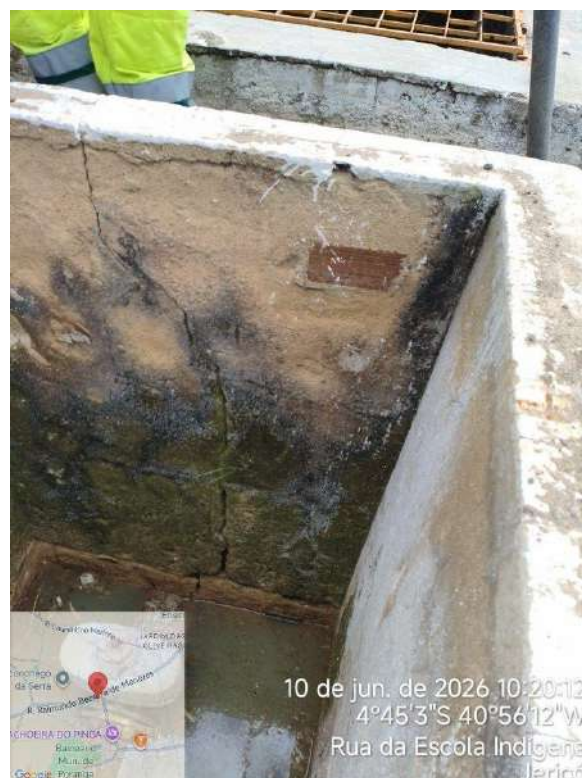
Foto 88 - EEE-01: caixa de registro com rachaduras e inundada.
