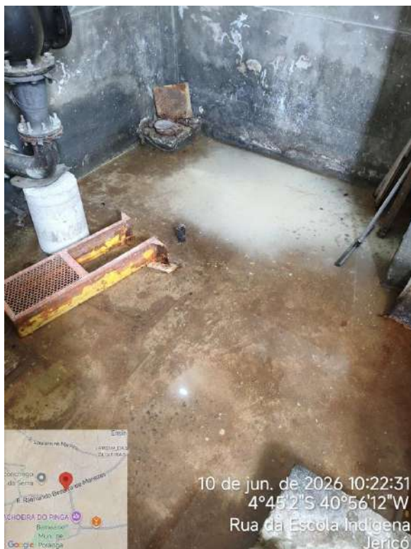
Foto 91 - EEE-01: fosso do barrilete com água empossada e sujeira.
