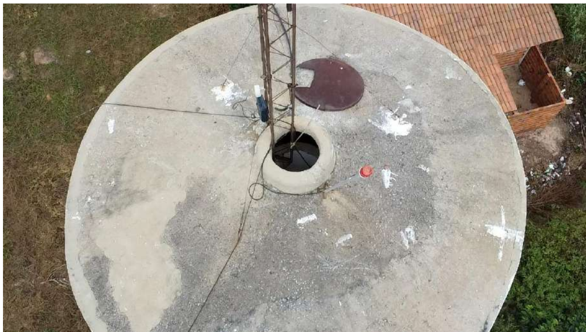
Foto 39 - REL-02: antena de terceiros instalada através da abertura de inspeção do reservatório.
