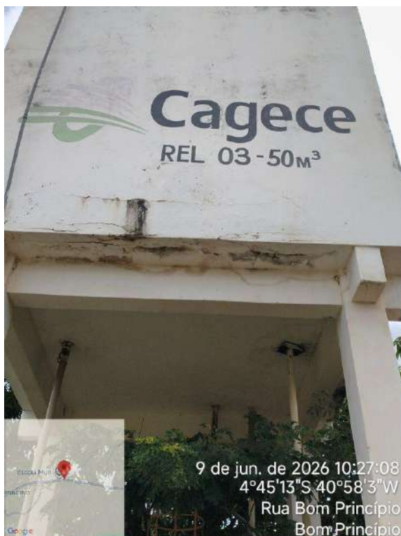
Foto 71 - REL-03: pintura deteriorada; rachaduras/fissuras na estrutura.
