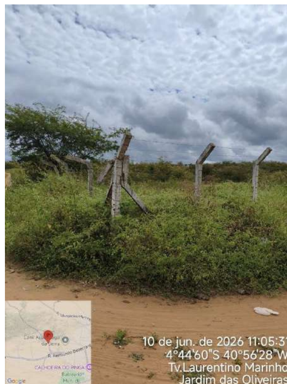
Foto 94 - ETE: cerca danificada.
