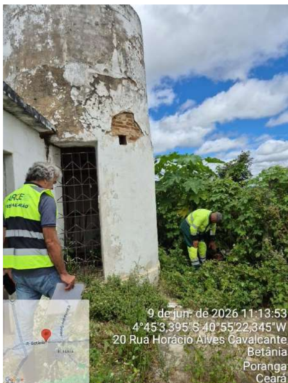
Foto 61 - PT-01: crescimento de vegetação na área do pátio.
