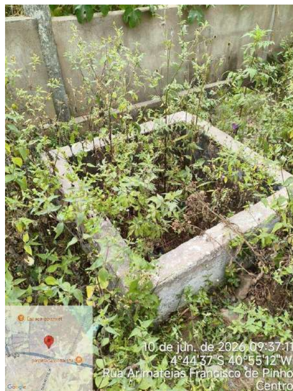
Foto 34 - RAP-01: caixa desprovida de tampa.
