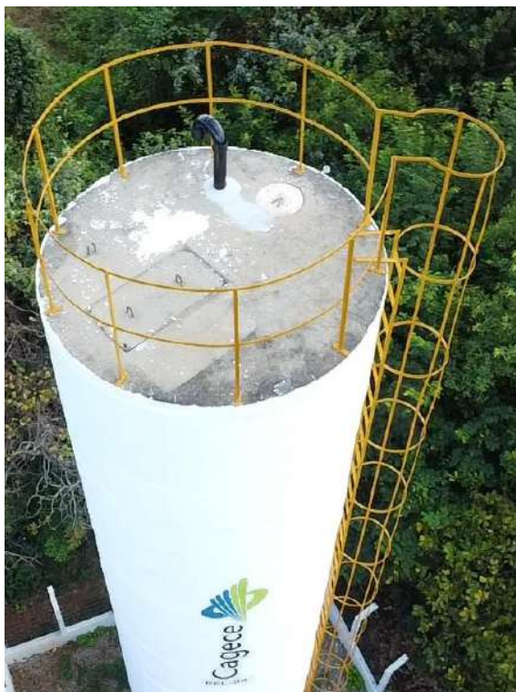
Foto 15 - REL-04: abertura de inspeção sem gola ou bordas verticais; reservatório sem pára-raios.
