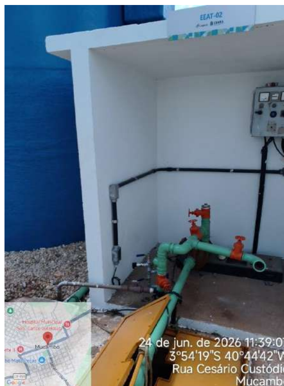
Foto 6 - ETA / EEAT-02: tubulação impedindo o fechamento hermético.
