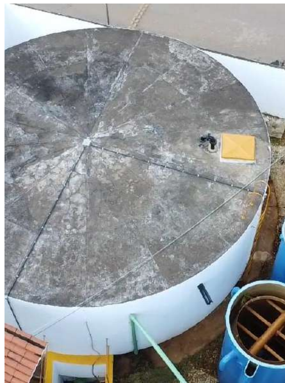
Foto 4 - ETA / RAP-02: escada de acesso sem guarda-corpo e sem grade de proteção acima do patamar superior.
