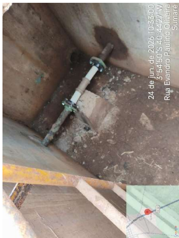
Foto 41 - EERD-02: tubulação com acúmulo de sujeira e entulhos.
