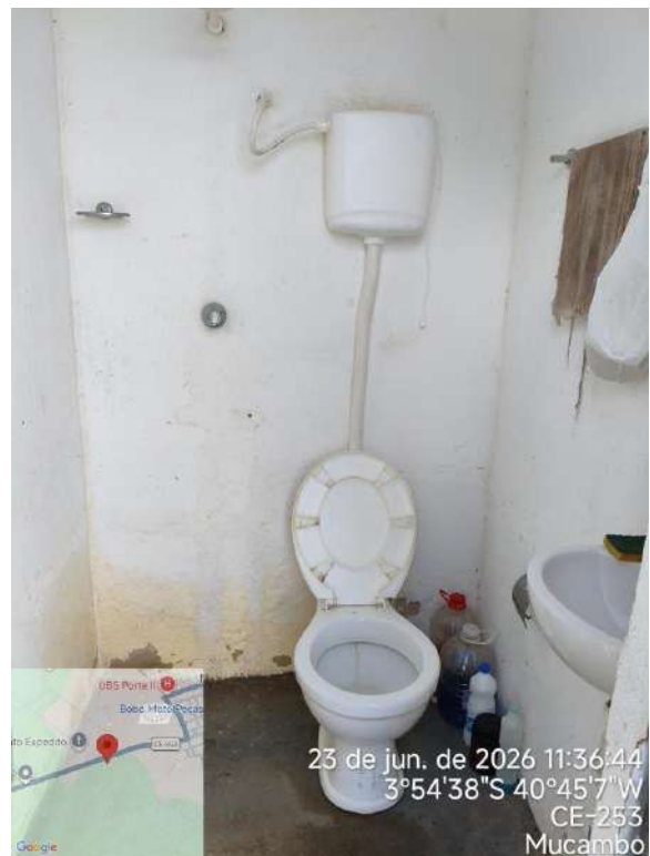
Foto 32 - ETE: banheiro sem revestimento impermeável e lavável.
