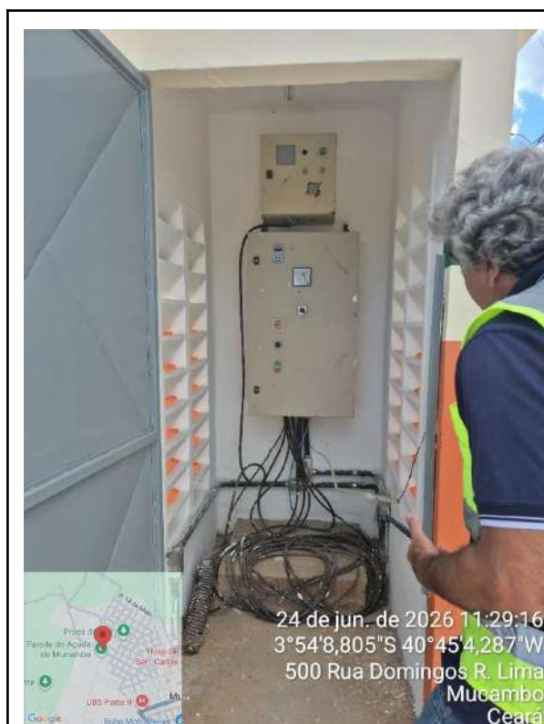
Foto 1 - Captação: fiação sem eletrodutos e iluminação interna não funcional.
