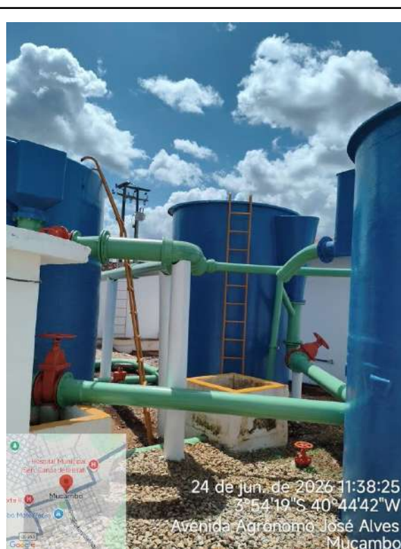
Foto 2 - ETA / Filtros: escadas de acesso sem guarda-corpo e fixação adequada.
