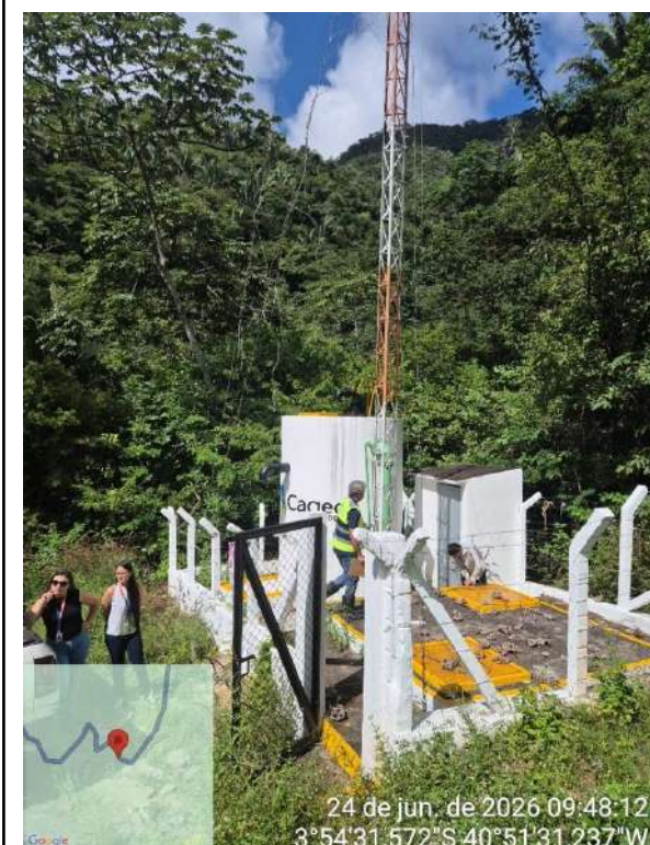
Foto 21 - DQP-02: área externa sem iluminação; portão sem tranca no ferrolho.
