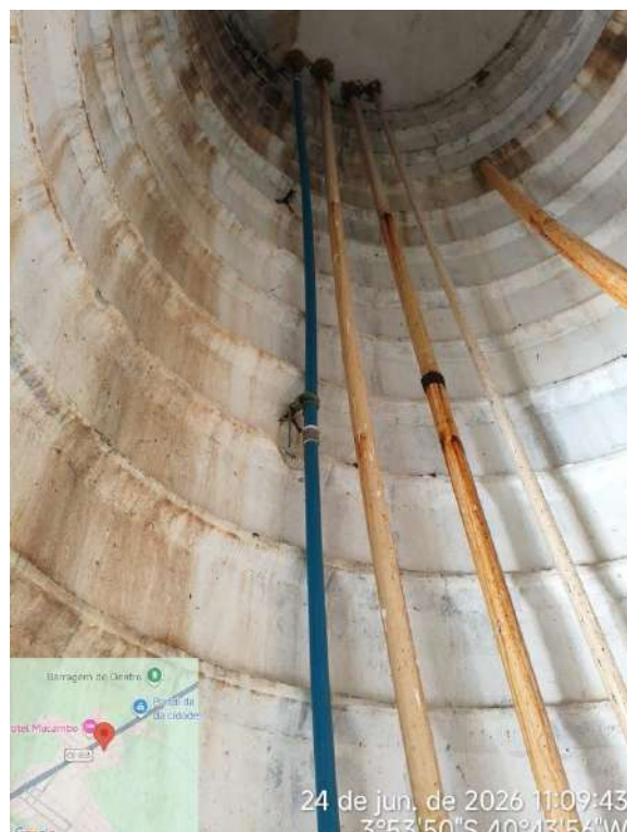
Foto 42 - REL-03: com vazamento.
