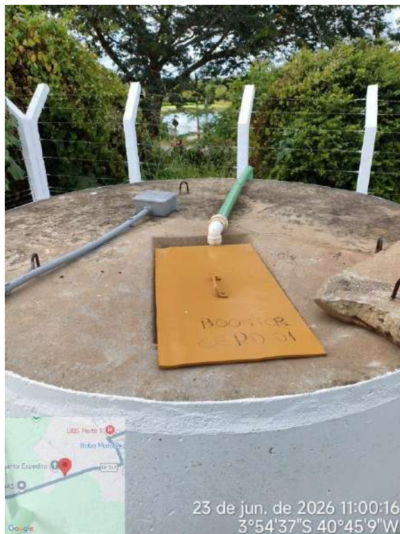
Foto 7 - EERD-01: abertura de inspeção sem gola ou bordas verticais; tubulação impedindo o fechamento hermético do reservatório.
