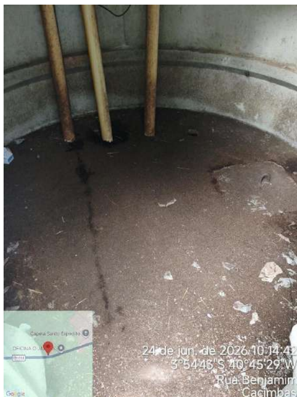
Foto 45 - REL-04: acúmulo de sujeira na base interna.
