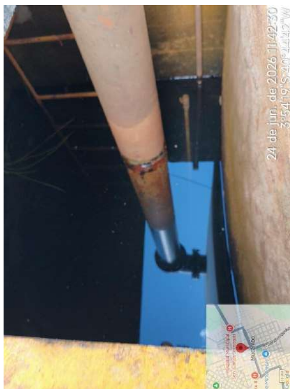
Foto 35 - ETA: caixa com acúmulo de água.
