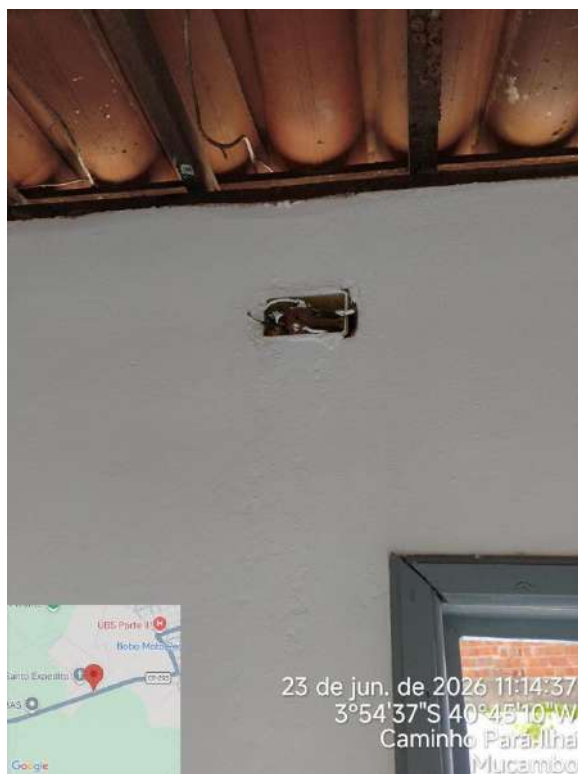
Foto 37 - EERD-01: sem lâmpada interna.
