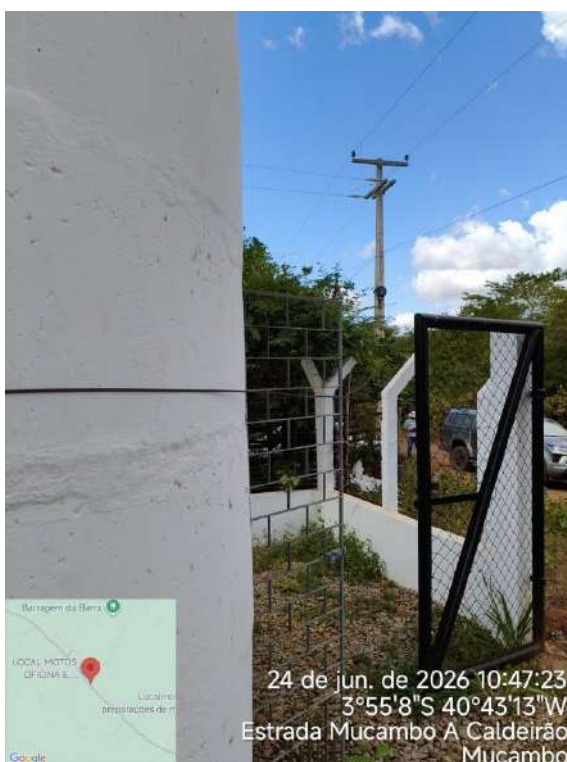
Foto 17 - REL-05: fiação de terceiros instalada em baixa altura, cruzando a área de circulação do reservatório.
