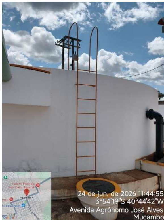
Foto 3 - ETA / RAP-01: escada de acesso sem guarda-corpo e sem grade de proteção acima do patamar superior.
