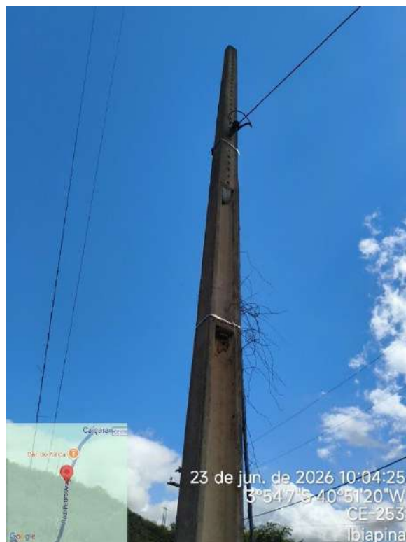
Foto 54 - REL-07: sem iluminação externa.
