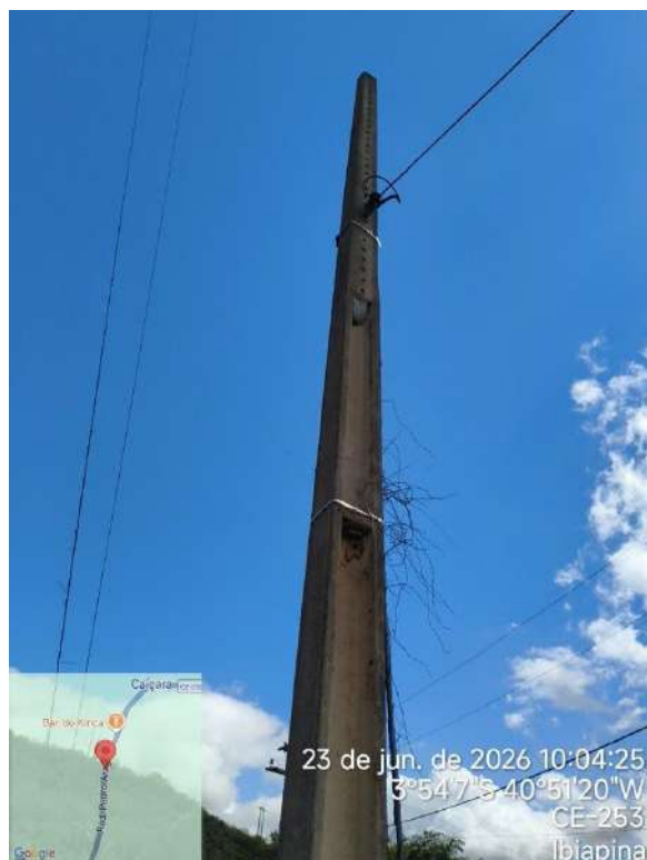
Foto 27 - REL-07: sem iluminação externa.
