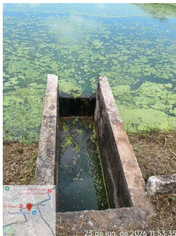
Foto 56 - ETE: saída do efluente deteriorada sem defletor de retenção de sobrenadantes.
