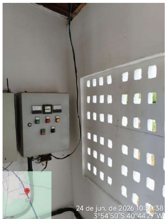
Foto 10 - EERD-02: fiação sem isolamento de proteção.
