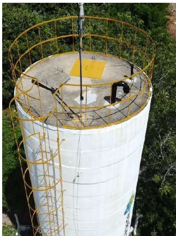
Foto 14 - REL-03: abertura de inspeção sem gola ou bordas verticais.
