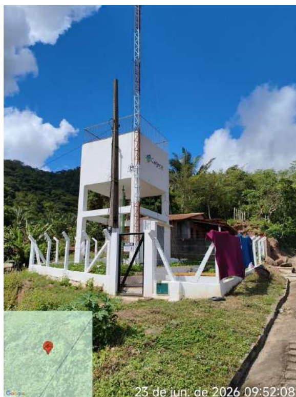
Foto 52 - REL-07: sem iluminação externa.
