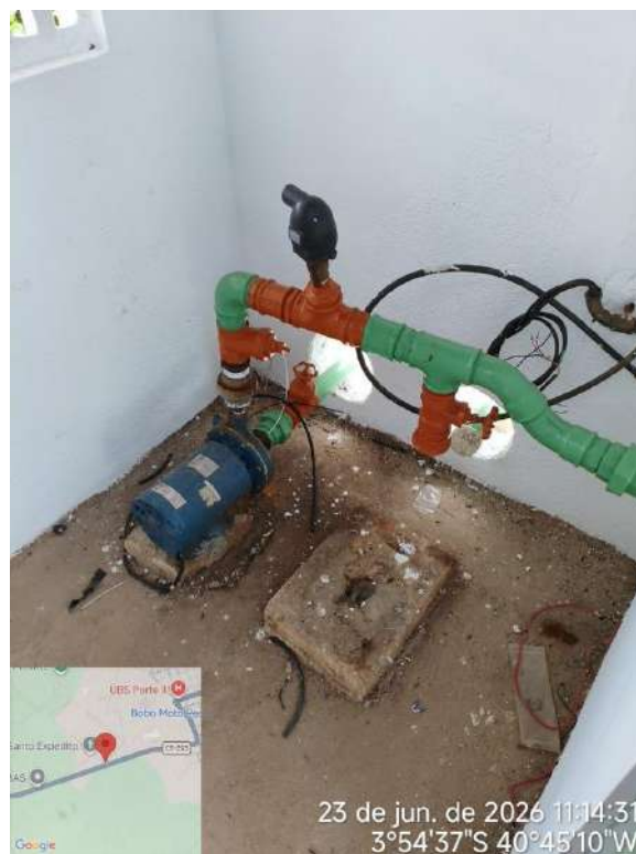
Foto 38 - EERD-01: sem bomba reserva instalada.
