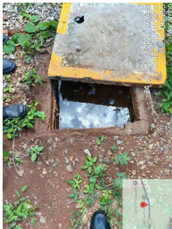
Foto 46 - REL-04: reservatório extravasando pelo dispositivo extravasor (ladrão), indicando falha operacional.
