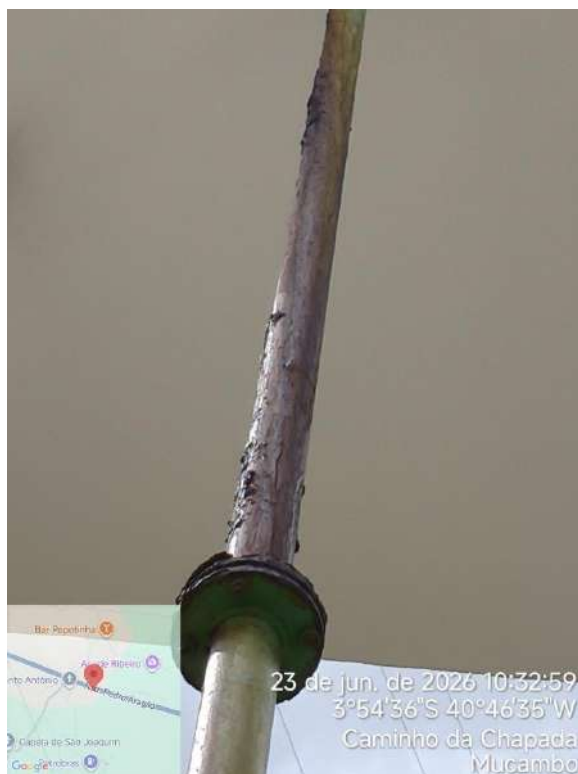
Foto 50 - REL-06: tubulação de saída em processo de corrosão/oxidação e com vazamento.
