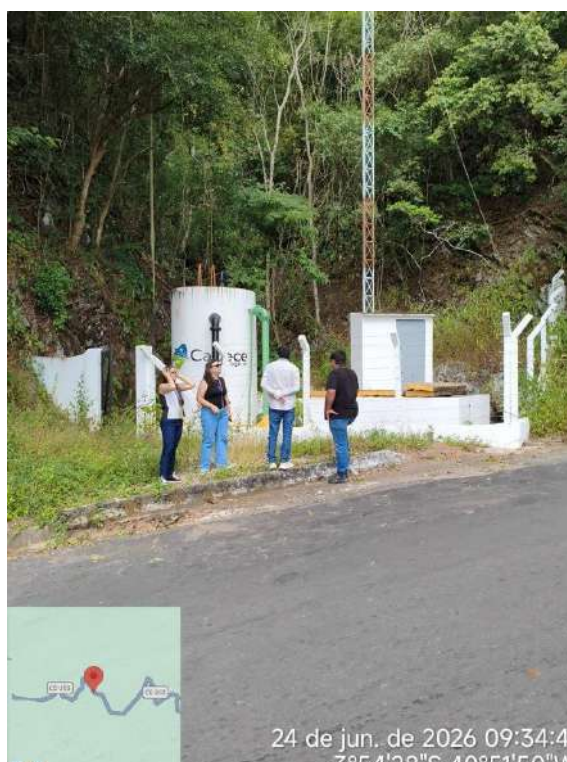
Foto 18 - DQP-01: área externa sem iluminação.
