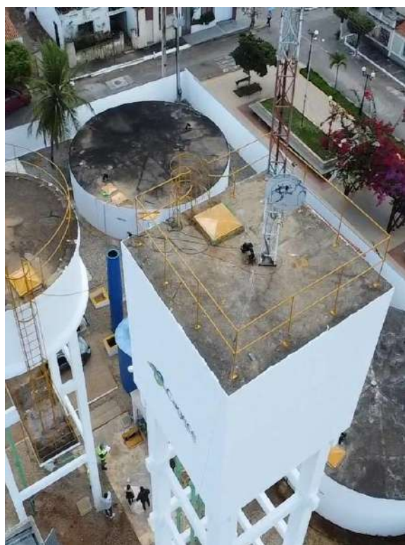
Foto 5 - ETA / REL-01 / REL-02: fiação sem isolamento de proteção e trespassando nas escadas dos reservatórios.
