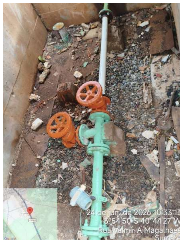
Foto 40 - EERD-02: tubulação com acúmulo de sujeira e entulhos.
