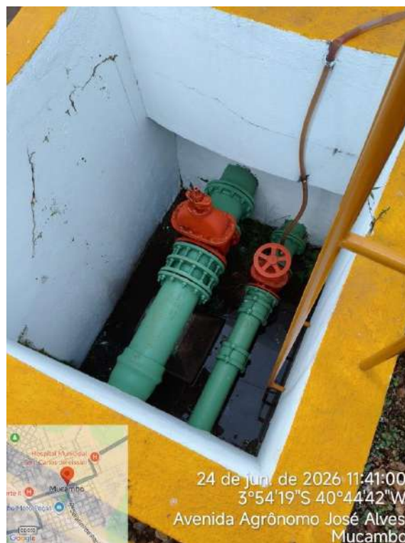
Foto 34 - ETA: caixa com acúmulo de água.
