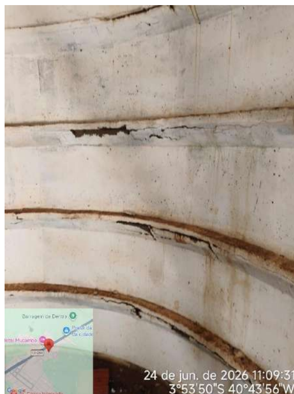
Foto 44 - REL-03: interior do fuste com armadura exposta.
