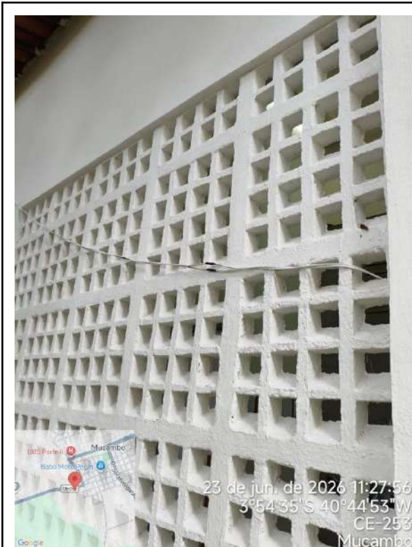
Foto 31 - EEE-01: instalações elétricas sem eletrodutos de proteção e isolamento.
