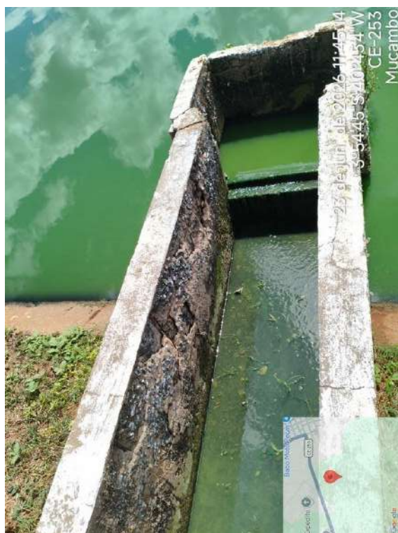
Foto 55 - ETE: saída do efluente deteriorada.
