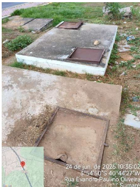
Foto 39 - EERD-02: tampas dos registros em processo avançado de corrosão/oxidação.
