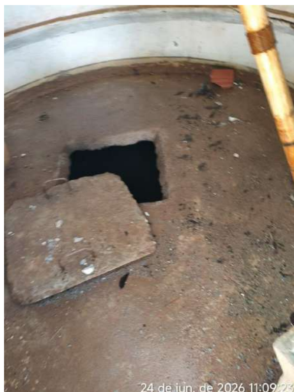
Foto 43 - REL-03: caixa abaixo do fuste com acúmulo de água.
