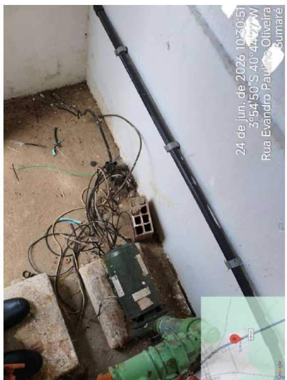
Foto 9 - EERD-02: fios sobre o piso, sem isolamento.
