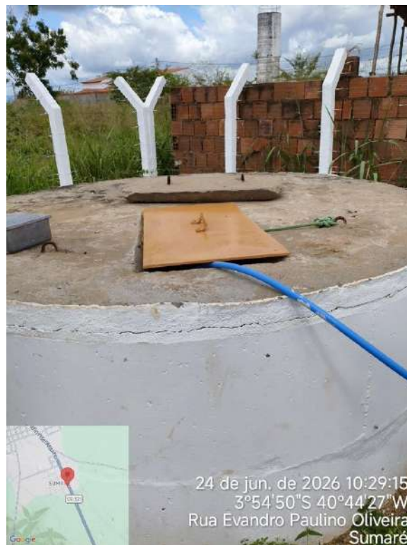
Foto 8 - EERD-02: abertura de inspeção sem gola ou bordas verticais; tubulação impedindo o fechamento hermético do reservatório.
