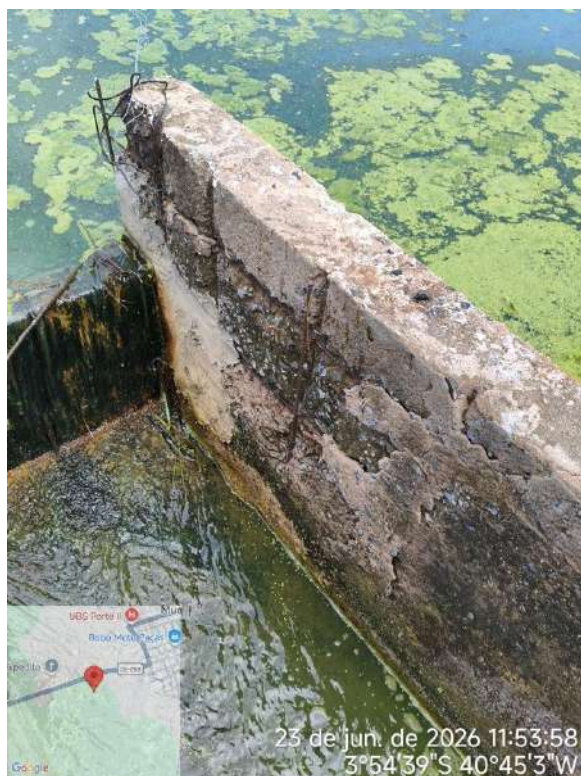
Foto 57 - ETE: saída do efluente deteriorada sem defletor de retenção de sobrenadantes.
