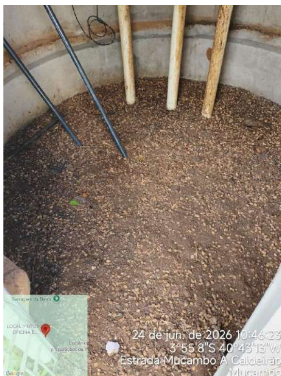
Foto 47 - REL-05: acúmulo de sujeira na base interna.
