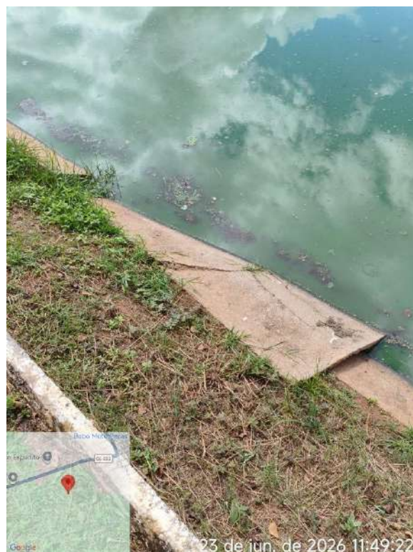
Foto 62 - ETE: placas de proteção dos taludes danificadas.
