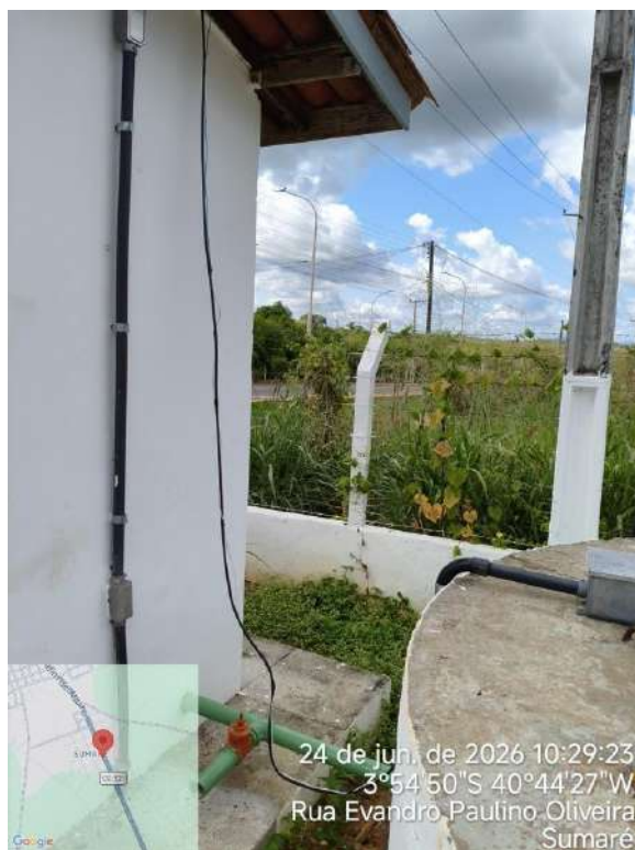
Foto 12 - EERD-02: fiação sem isolamento de proteção.
