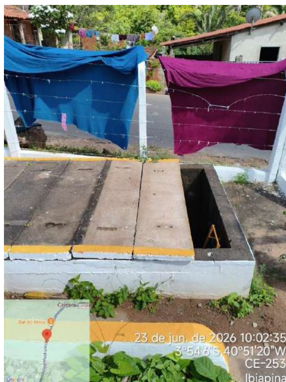
Foto 51 - REL-07: caixa da válvula retentora de pressão com tampa fora do lugar.
