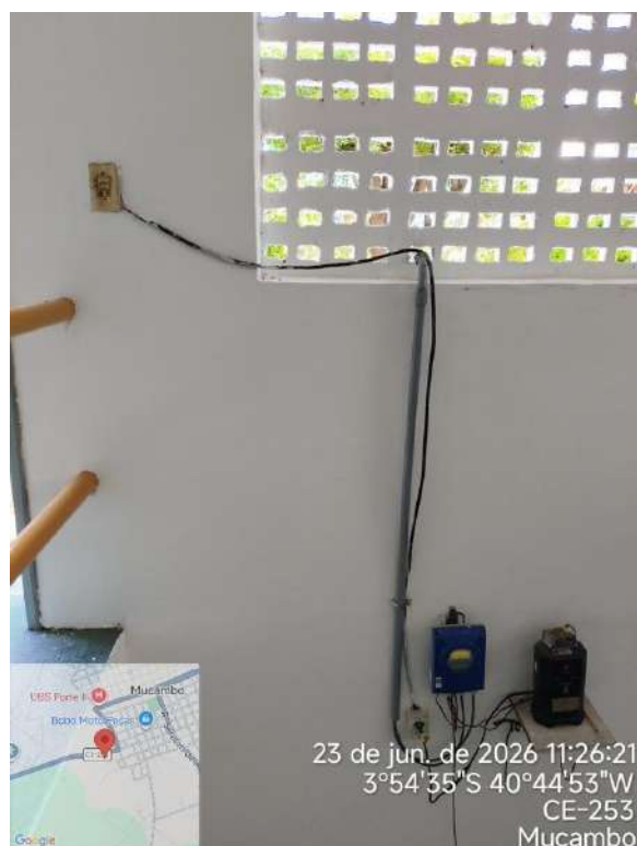
Foto 30 - EEE-01: instalações elétricas sem eletrodutos de proteção e isolamento.
