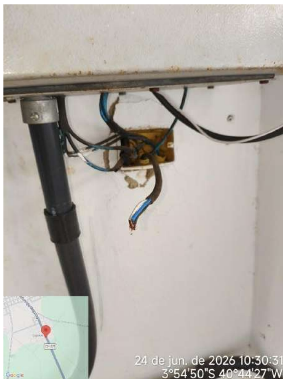
Foto 11 - EERD-02: fiação sem isolamento de proteção.
