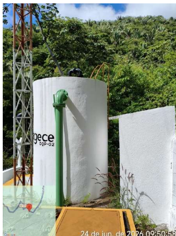
Foto 22 - DQP-02: escada incompleta, sem gaiola e guarda-corpo de proteção no patamar superior.
