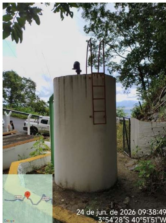
Foto 20 - DQP-01: escada incompleta, sem guarda-corpo e proteção no patamar superior.
