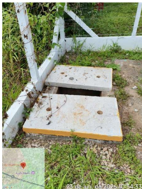
Foto 48 - REL-06: caixa de proteção com tampa deslocada.
