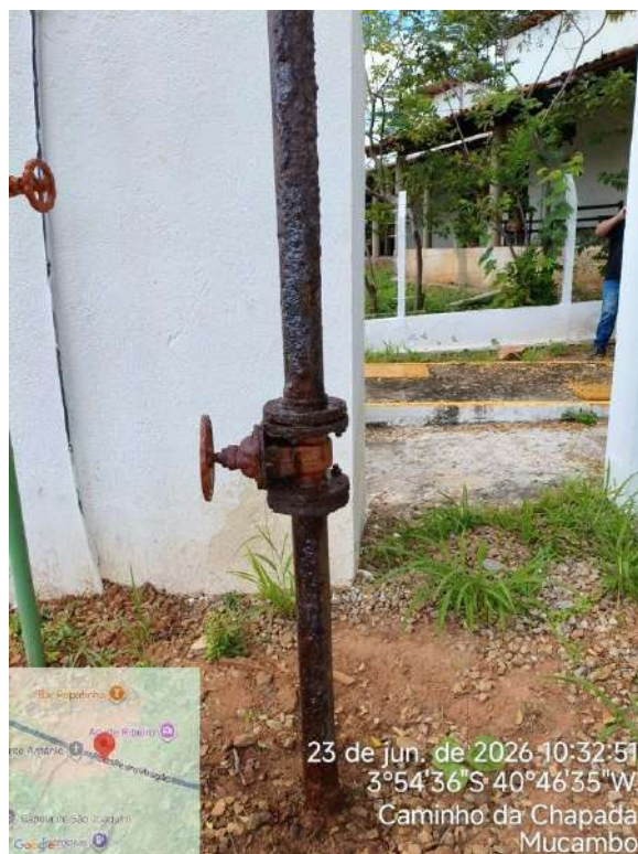
Foto 49 - REL-06: tubulação de saída em processo de corrosão/oxidação, e com vazamento.
