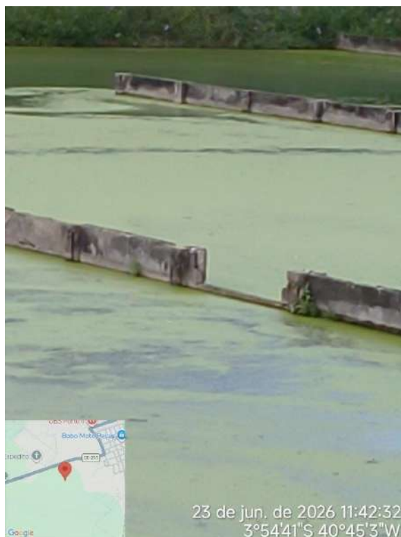
Foto 61 - ETE: placas dos taludes desgastadas e/ou quebradas.
