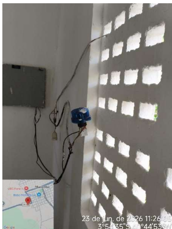
Foto 29 - EEE-01: instalações elétricas sem eletrodutos de proteção e isolamento.
