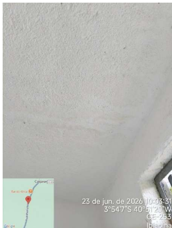
Foto 28 - REL-07: sem iluminação na casa de comando.
