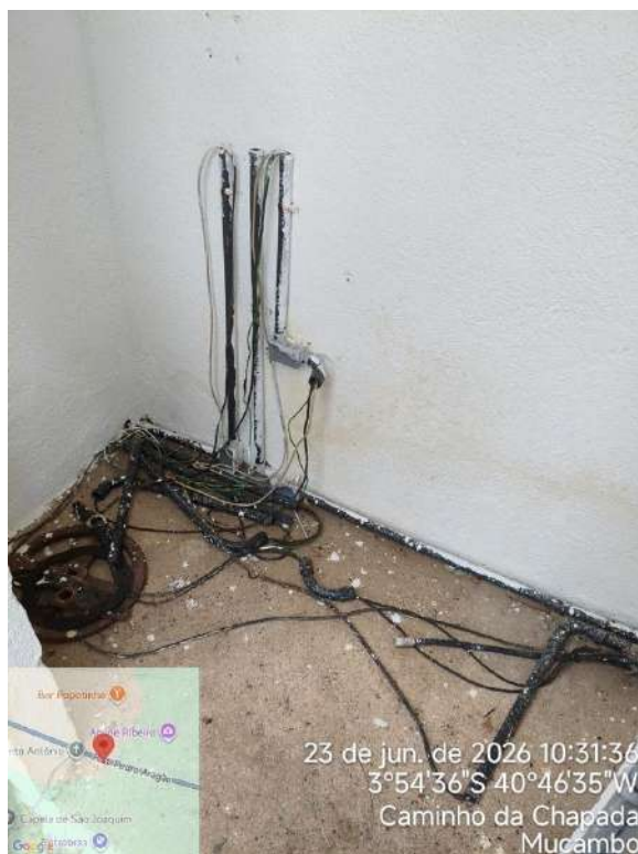
Foto 26 - REL-06: fios sem eletrodutos de proteção e isolamento, instalados sobre o piso da casa do quadro de comando.
