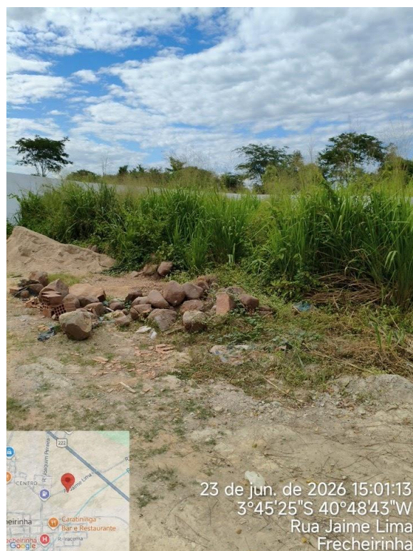
Foto 71 - EEE-01: vegetação crescida e acúmulo de entulho na área interna.
