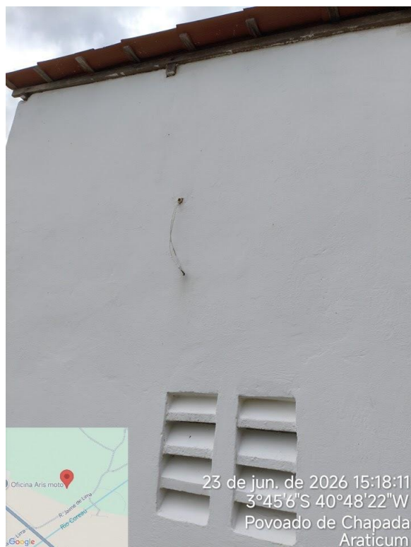
Foto 41 - ETE: sem iluminação na área externa e na casa de apoio.
