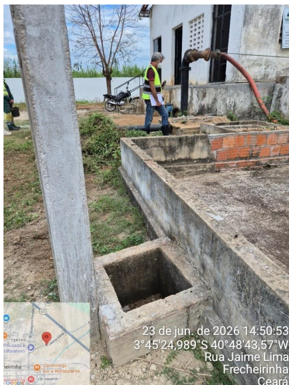
Foto 33 - EEE-01: caixas sem tampa ou grade de proteção.
