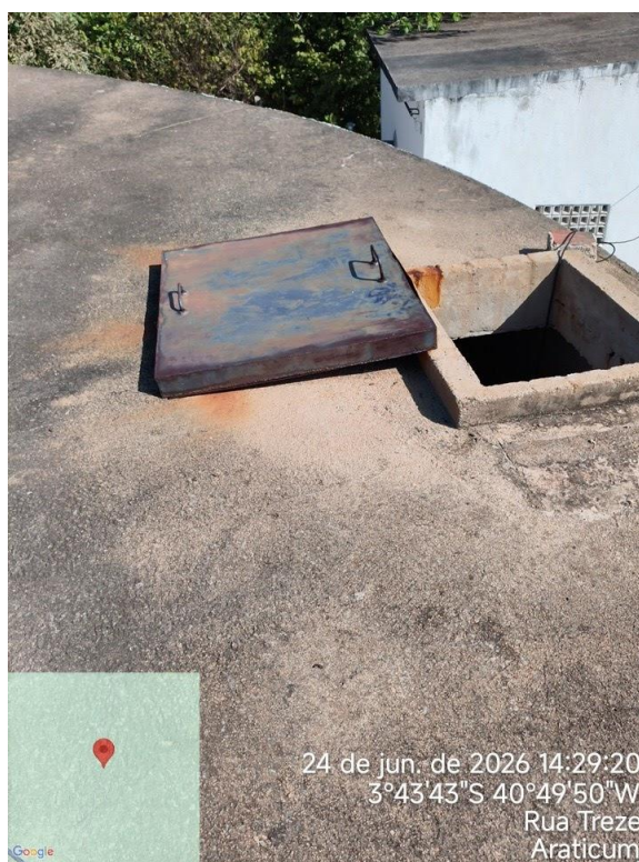
Foto 60 - RAP-03: tampa do reservatório oxidada e deslocada.
