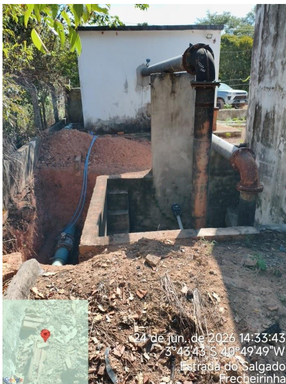
Foto 25 - EEAT-03: fosso hidráulico sem grade de proteção, e escada sem corrimão.
