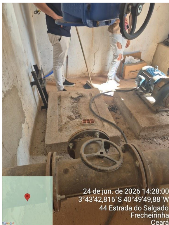
Foto 27 - EEAT-03: instalações elétricas inadequadas, fiação sem eletrodutos, sem bomba reserva.
