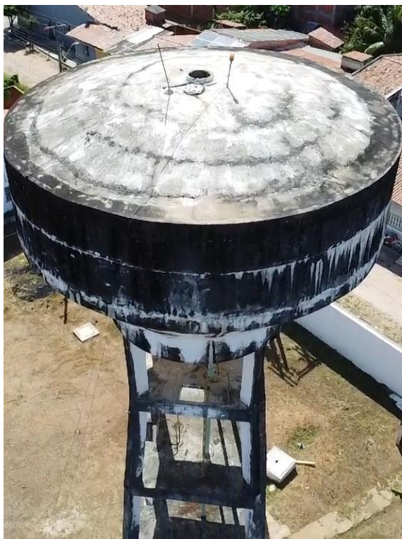
Foto 23 - REL-02: sem identificação, laje superior e plataformas sem guarda-corpo.
