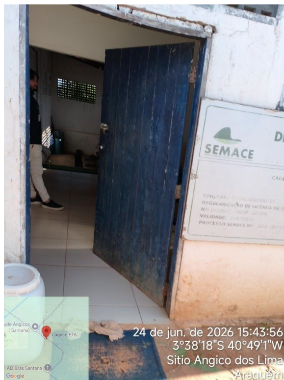
Foto 15 - ETA / Laboratório_Casa de Química_Casa de Bombas (EEAT-01/EELF-01): ambientes contíguos sem isolamento dos ruídos da área de permanência do operador.
