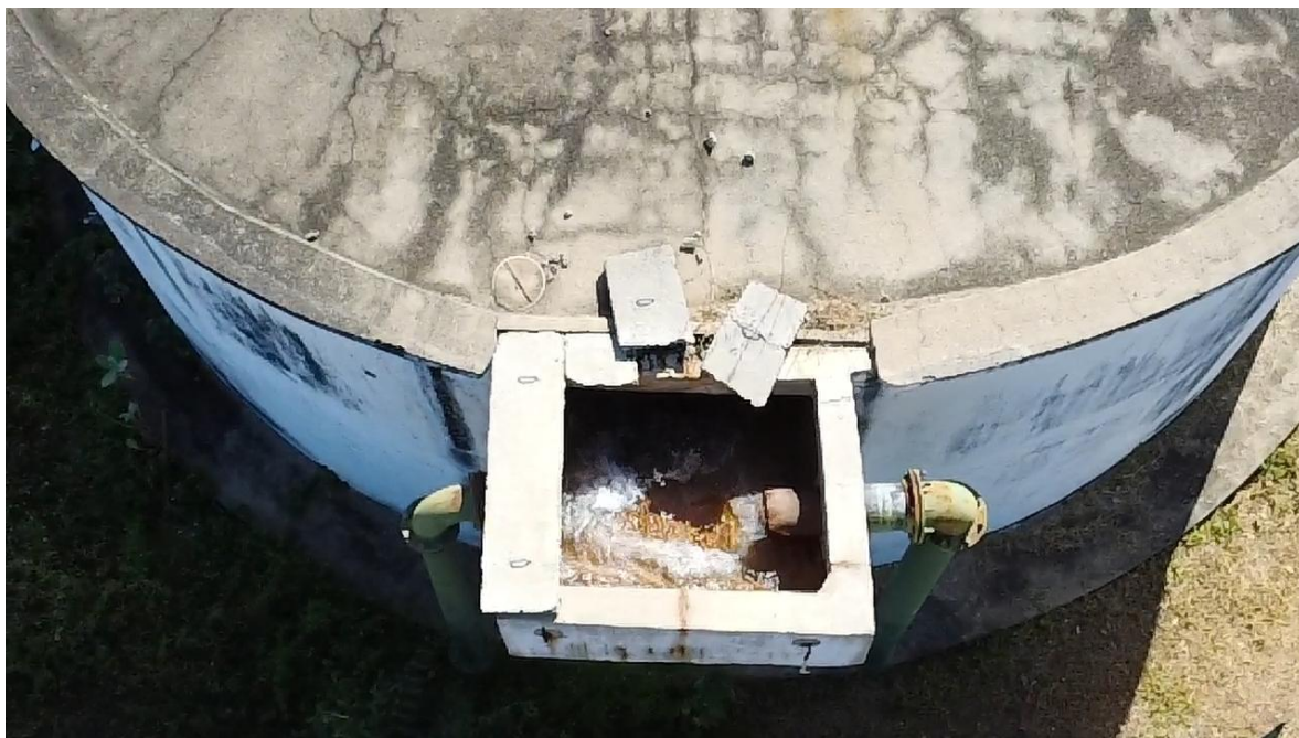
Foto 58 - RAP-02: tampa da caixa de passagem quebrada, pintura e identificação desgastadas.
