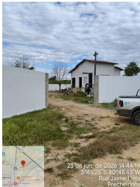
Foto 32 - EEE-01: sem identificação e sem portão de acesso.
