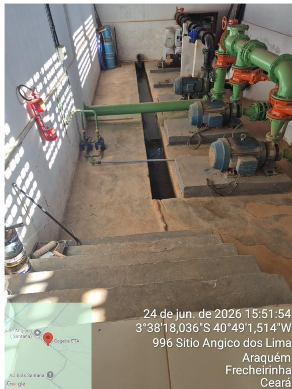
Foto 12 - ETA / Laboratório_Casa de Química_Casa de Bombas (EEAT-01/EELF-01): escada sem corrimão, calha sem grade de proteção.
