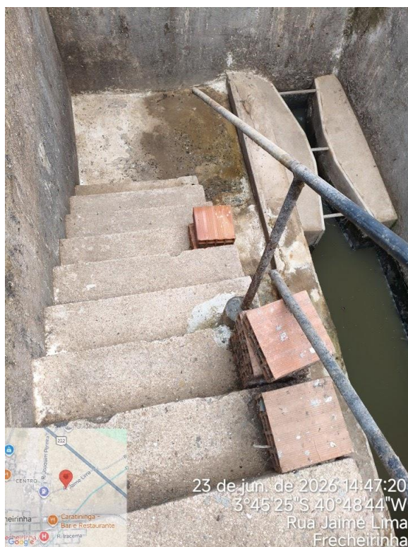
Foto 70 - EEE-01: corrimão oxidado e sem fixação, apoiado em tijolo.
