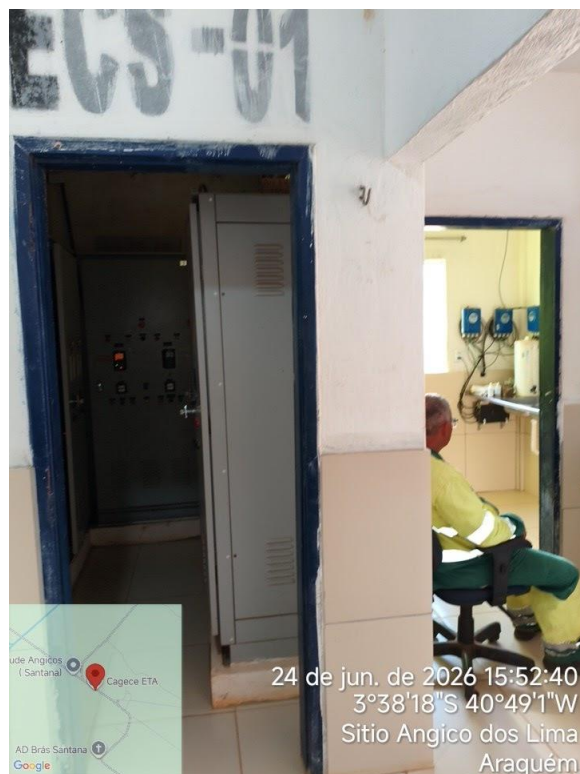
Foto 16 - ETA / Laboratório_Casa de Química_Casa de Bombas (EEAT-01/EELF-01): ambientes contíguos sem isolamento dos ruídos da área de permanência do operador.
