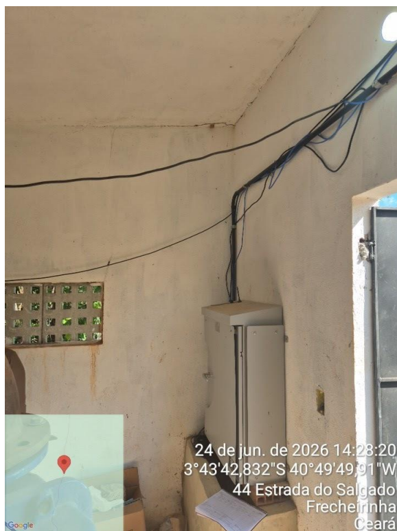
Foto 28 - EEAT-03: instalações elétricas inadequadas, fiação sem eletrodutos.
