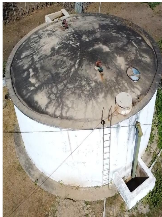
Foto 24 - RAP-02: sem identificação; caixa sem tampa, escada sem gaiola e guarda-corpo de proteção na laje de cobertura; fiação inadequada.
