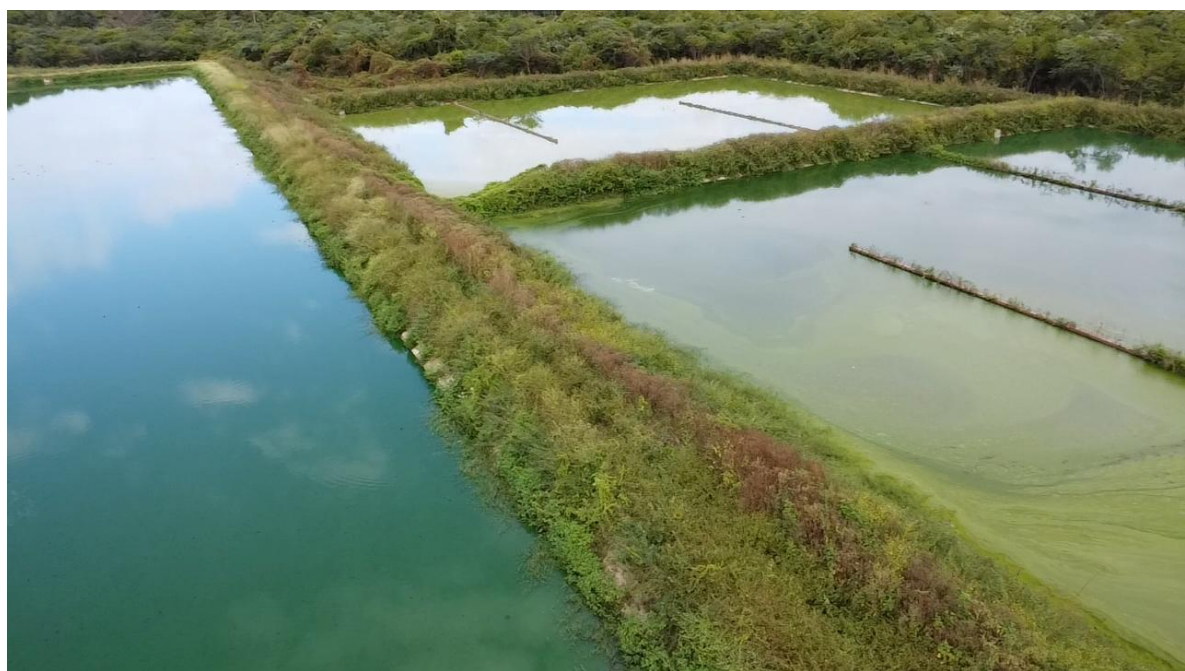
Foto 74 - ETE: lagoas com taludes tomados por vegetação crescida, avançando sobre a área de circulação.
