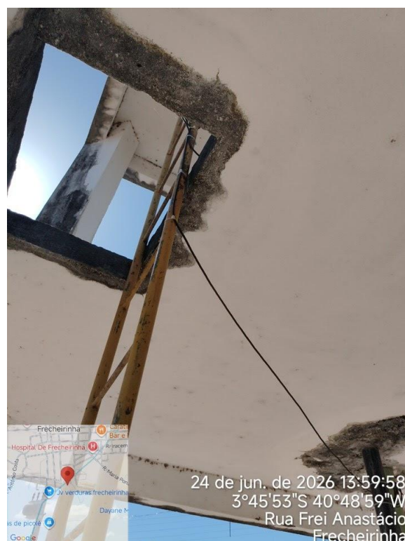
Foto 22 - REL-02: fiação sem eletrodutos e presa à escada; escada sem gaiola de proteção.
