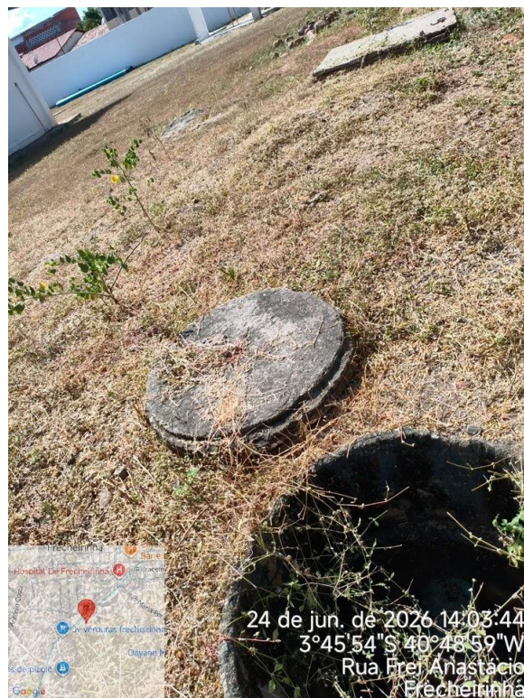
Foto 18 - RAP-02 / EEAT-02 / REL-02 / Pátio: caixa sem tampa.
