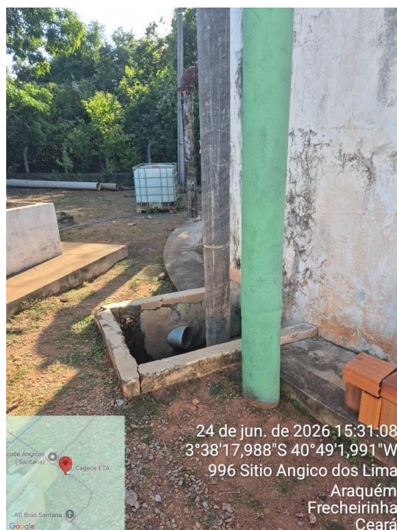
Foto 6 - ETA / Pátio: caixas sem tampa ou grade de proteção.
