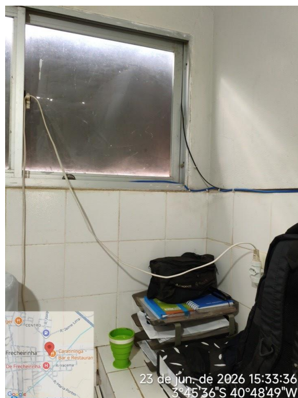
Foto 46 - Núcleo: instalações elétricas e eletrônicas precárias, sem eletrodutos de proteção e isolamento.
