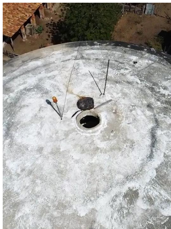
Foto 56 - REL-02: tampa deslocada e oxidada, pintura e identificação desgastadas.
