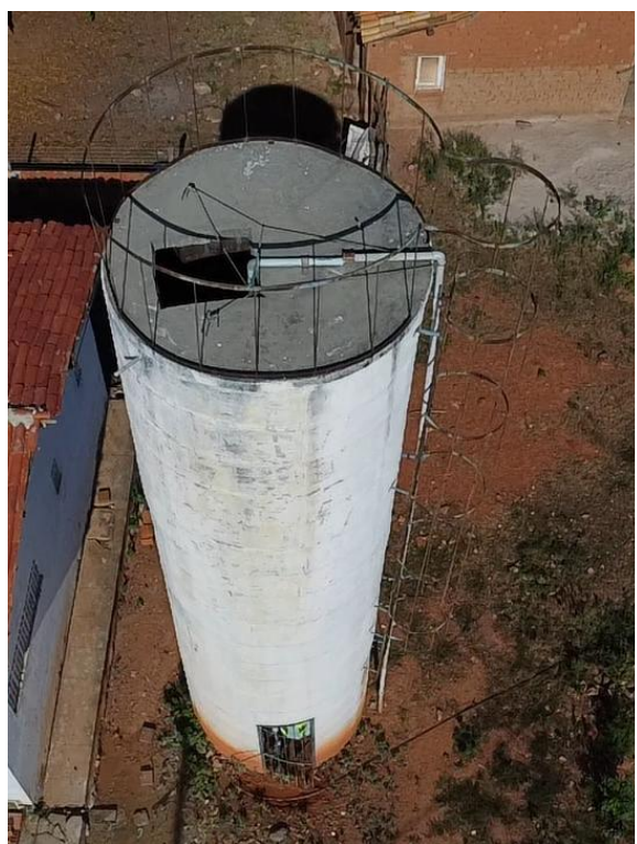
Foto 30 - REL-03: sem identificação, sem tampa e sem cerca delimitando o local.
