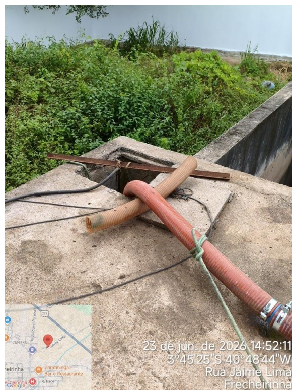
Foto 36 - EEE-01: fiação inadequada sem eletrodutos passando pela abertura de inspeção do poço de sucção.
