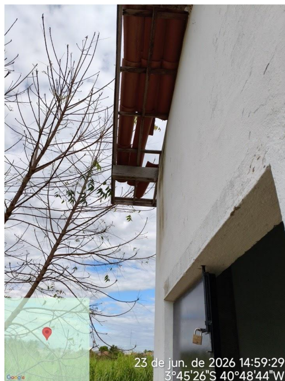
Foto 67 - EEE-01: telhado danificado.
