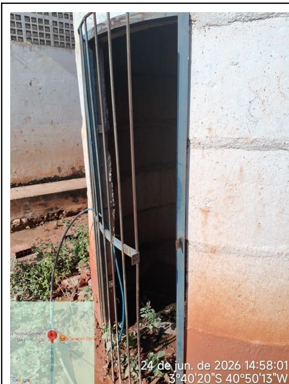
Foto 64 - REL-03: portão de acesso oxidado e empenado, não fecha corretamente.
