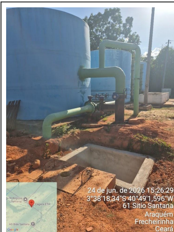
Foto 3 - ETA / Pátio: caixas sem tampa ou grade de proteção.
