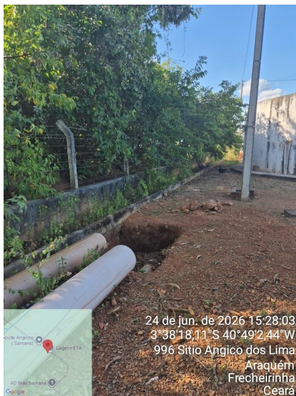
Foto 7 - ETA / Pátio: escavações para implantação de caixas de proteção não concluídas.
