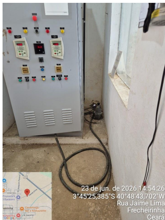
Foto 38 - EEE-01: fiação sem eletrodutos.
