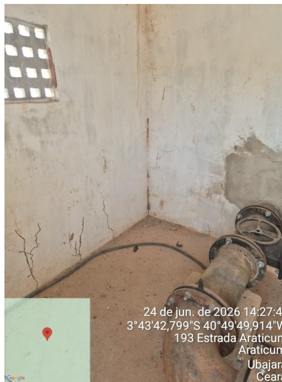
Foto 26 - EEAT-03: instalações elétricas inadequadas, fiação sem eletrodutos.
