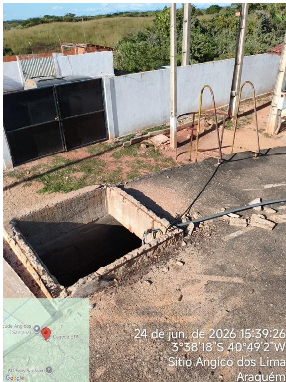
Foto 11 - ETA / RAP-01: fiação transpassa a abertura de inspeção sem proteção; sem tampa e com armadura exposta.
