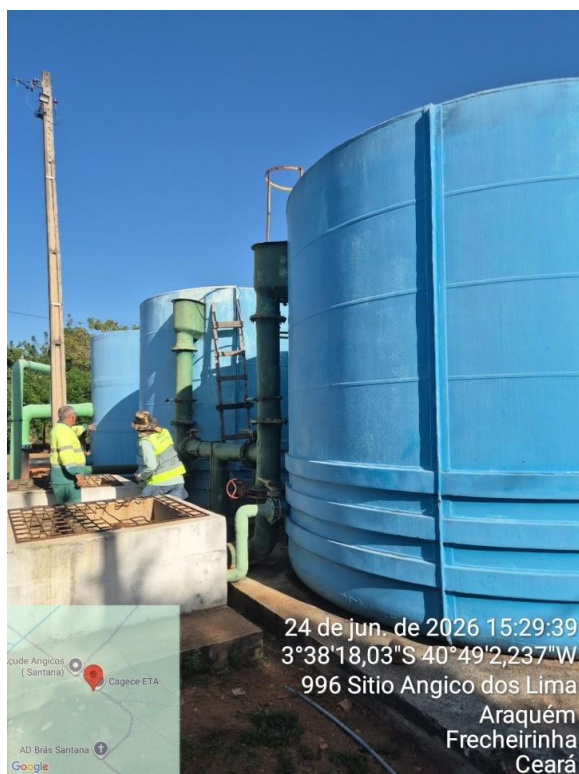
Foto 9 - ETA / Filtros: sem identificação; F-02 com escada improvisada, sem guarda-corpo e fixação.
