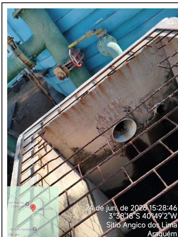
Foto 49 - ETA: caixa com grade danificada.
