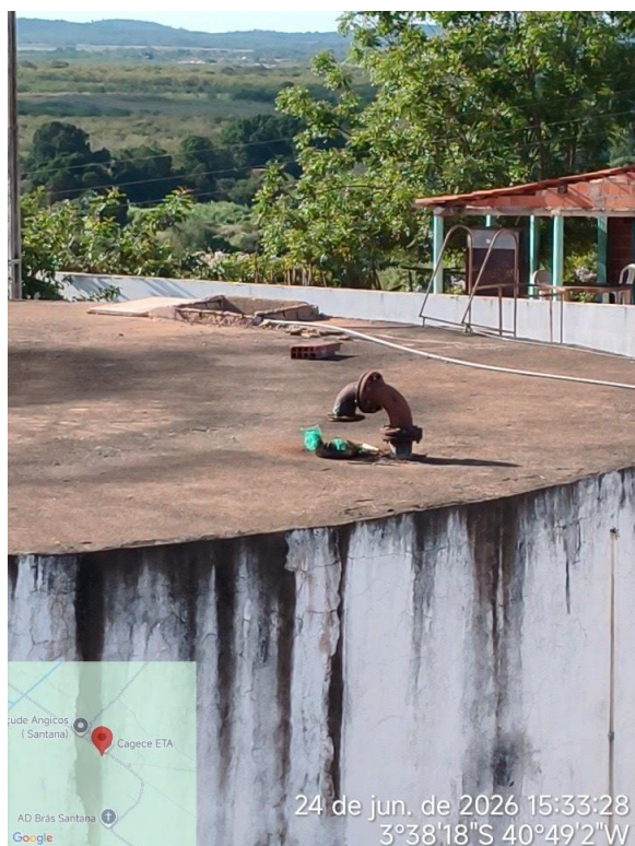
Foto 10 - ETA / RAP-01: fiação conduzida na abertura de inspeção sem proteção; sem guarda-corpo na laje superior.
