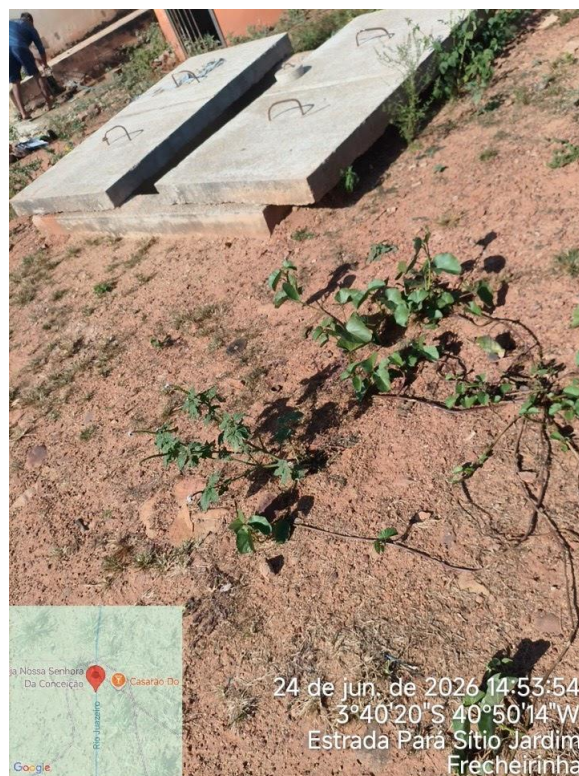
Foto 65 - REL-03: caixa de registro com tampas deslocadas.
