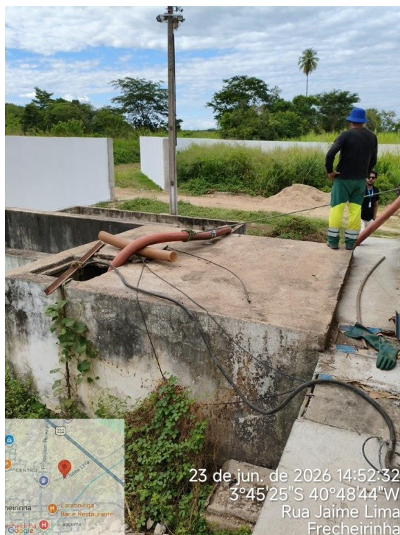
Foto 35 - EEE-01: plataforma do poço de sucção sem grade de proteção / guarda-corpo.
