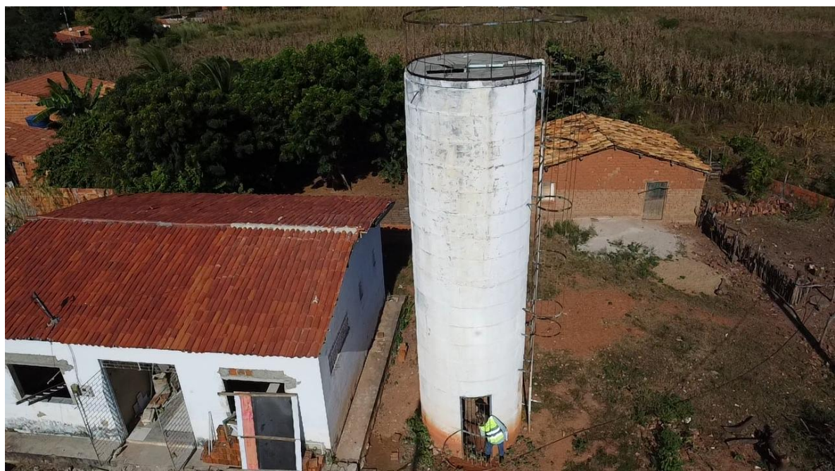
Foto 63 - REL-03: pintura desgastada.
