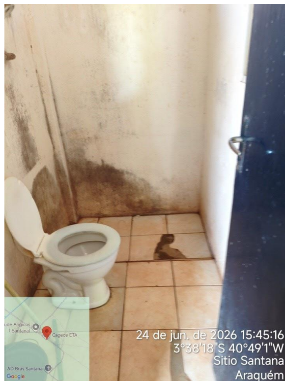
Foto 14 - ETA / Laboratório_Casa de Química_Casa de Bombas (EEAT-01/EELF-01): banheiro com parede sem revestimento lavável.
