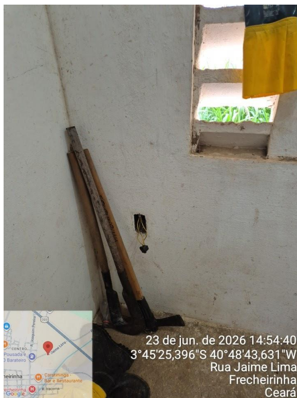
Foto 68 - EEE-01: caixa da tomada danificada.
