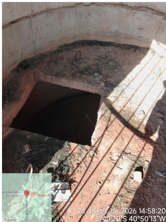
Foto 31 - REL-03: caixa sem tampa de proteção da abertura de inspeção.
