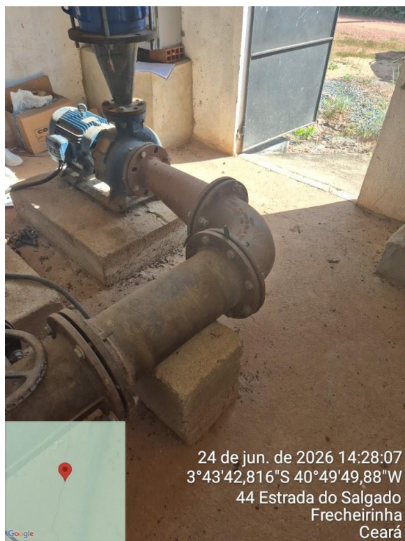
Foto 62 - EEAT-03: casa de bombas com sujeira.
