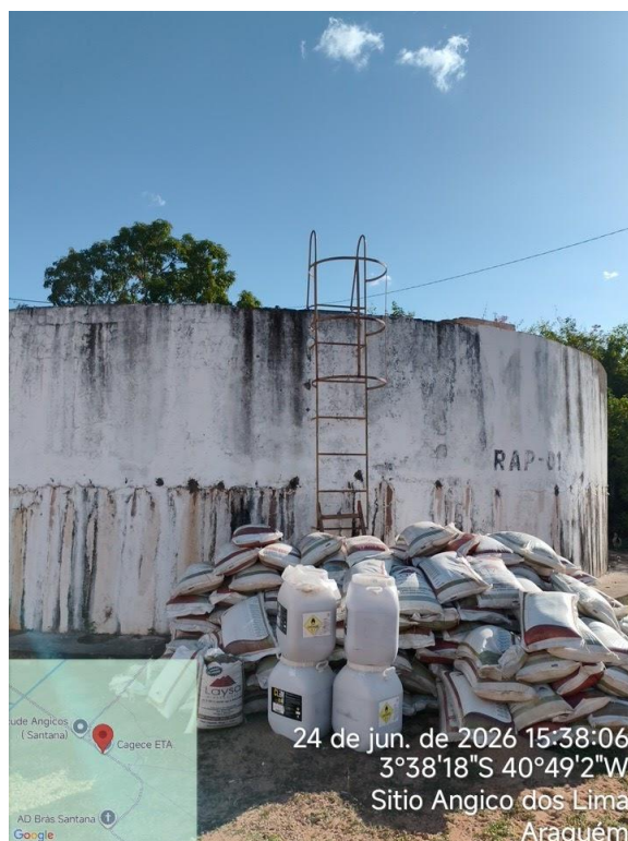
Foto 53 - ETA / RAP-01: pintura deteriorada e identificação apagada.
