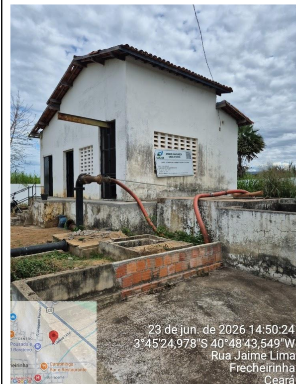
Foto 66 - EEE-01: pintura desgastada.
