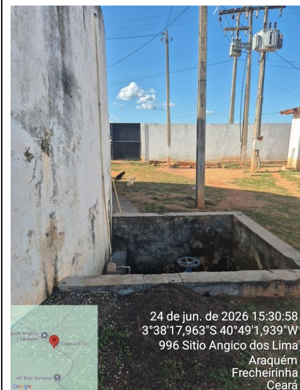
Foto 5 - ETA / Pátio: caixas sem tampa ou grade de proteção.
