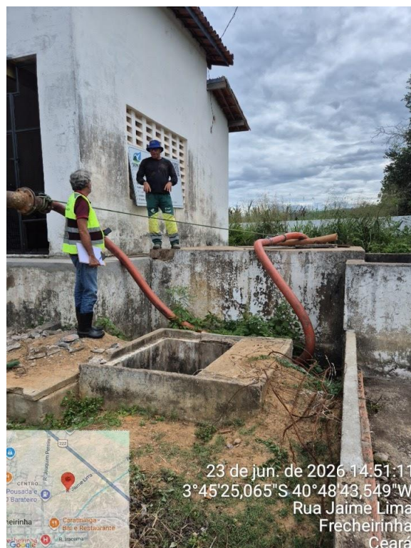
Foto 34 - EEE-01: caixas sem tampa ou grade de proteção; plataforma do poço de sucção sem grade de proteção / guarda-corpo.
