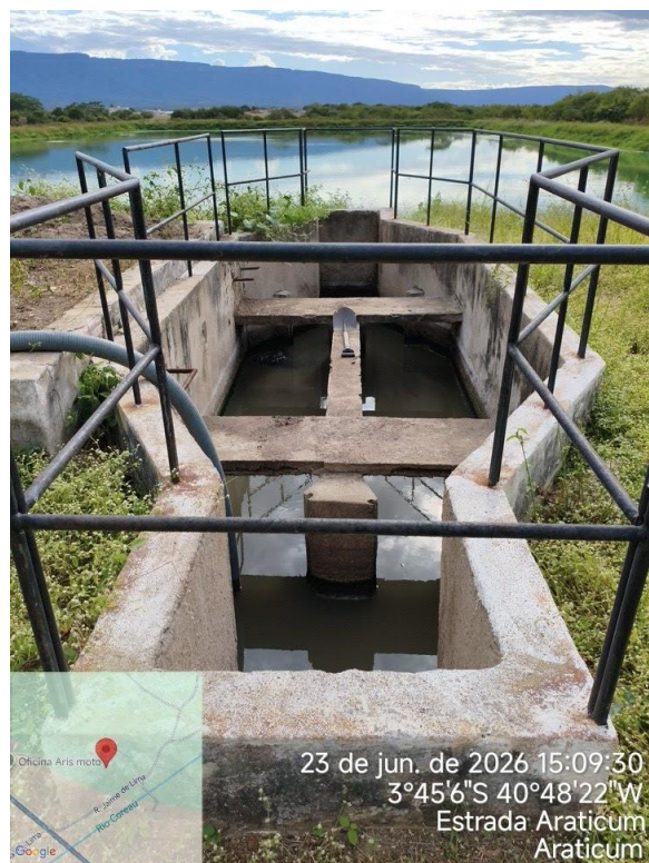
Foto 40 - ETE: tratamento preliminar sem comportas (stop logs).
