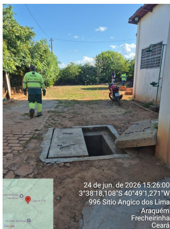
Foto 50 - ETA: caixa com tampa fora do lugar.
