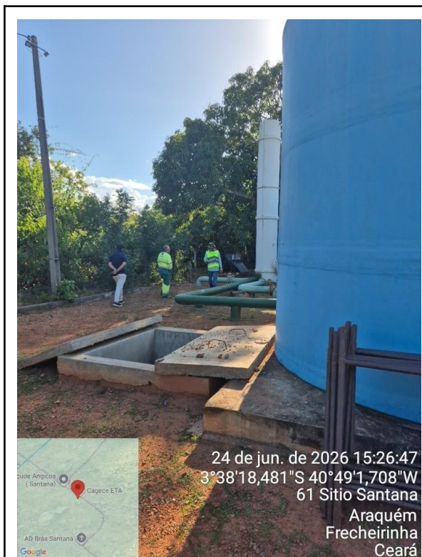
Foto 51 - ETA: caixa com tampa fora do lugar.
