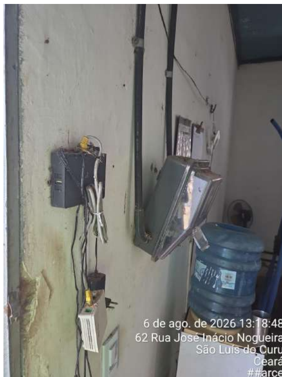
Foto 37 - EEAT-01: fiação exposta, improvisada e desorganizada, medidor de energia elétrica parcialmente desprendido da parede e sinais de deterioração da parede.
