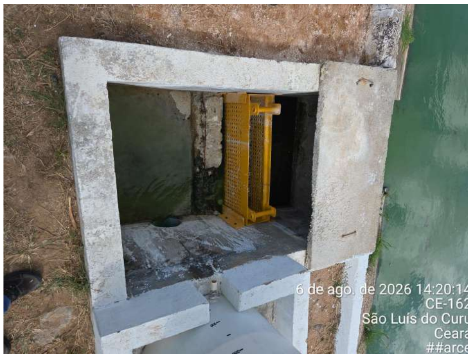
Foto 127 - Lagoa de maturação: ausência de tampa na caixa de inspeção do vertedouro da lagoa.
