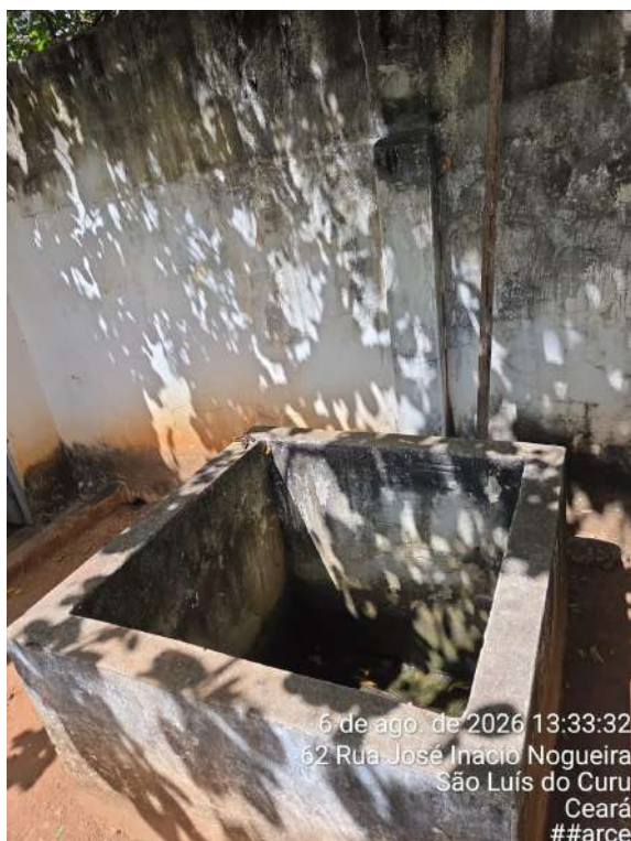
Foto 12 - Caixa de passagem dos filtros de fibra (F-03 e F-04) da ETA: desprovida de grade ou tampa de proteção.
