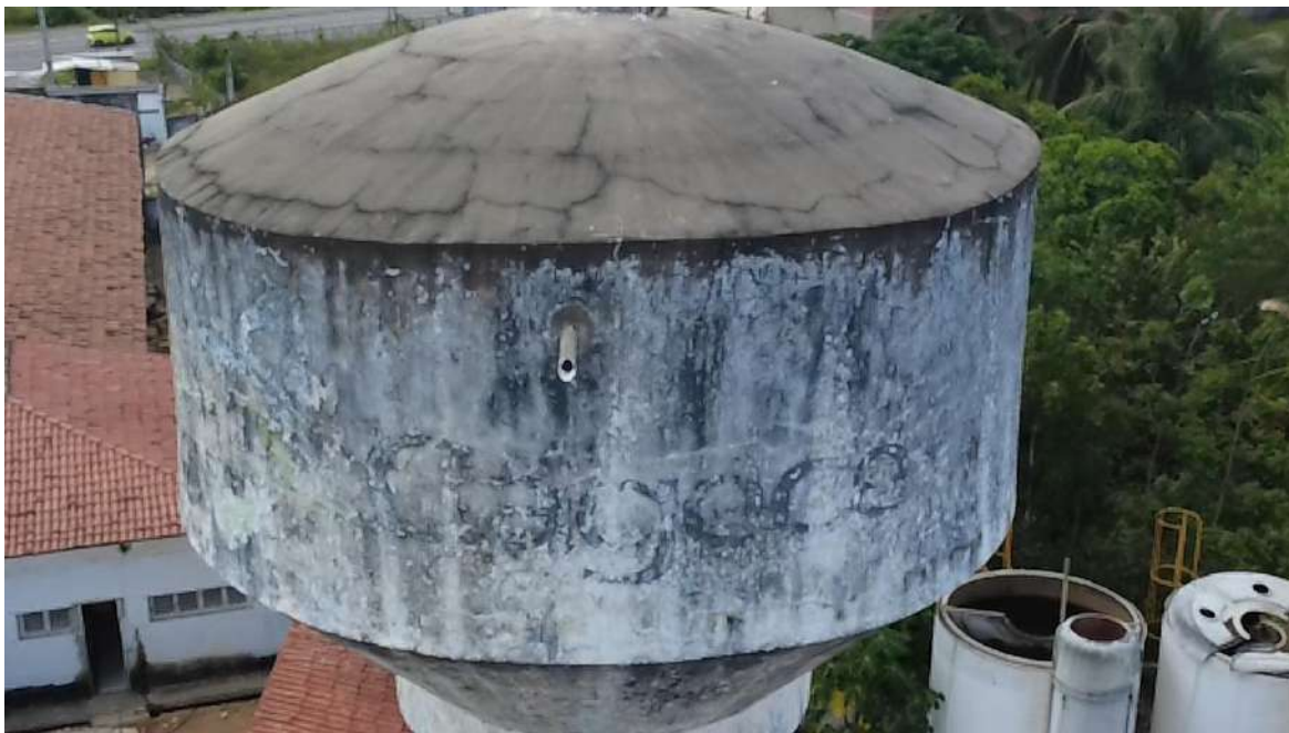
Foto 66 - REL-01: fissuras na cobertura e sinais de umidade e de deterioração no revestimento externo, além de tubulação com abertura desprovida de proteção adequada.
