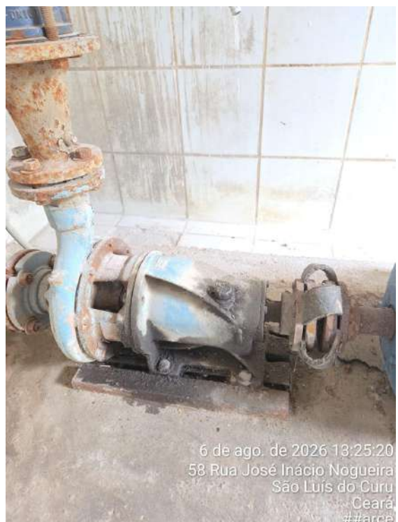
Foto 31 - EEAT-02: conjunto motobomba com corrosão, acoplamento com proteção danificada e sinais de vazamento de óleo.
