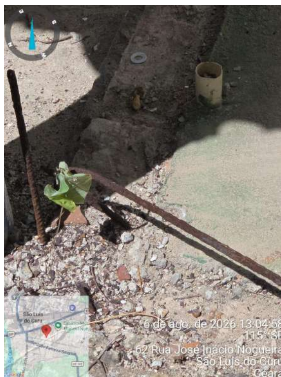
Foto 49 - Área de circulação e acesso operacional da ETA: piso deteriorado, com armaduras metálicas expostas.
