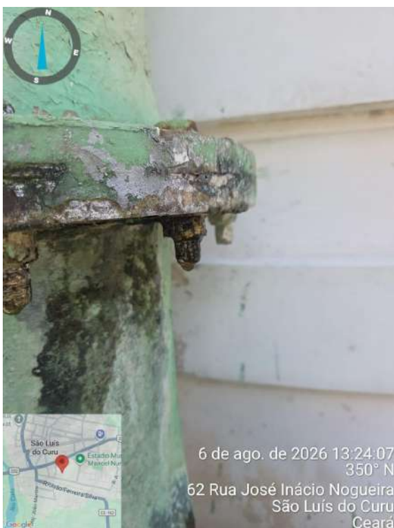
Foto 34 - Filtro de fibra 4 (F-04) da ETA: oxidação e vazamento.
