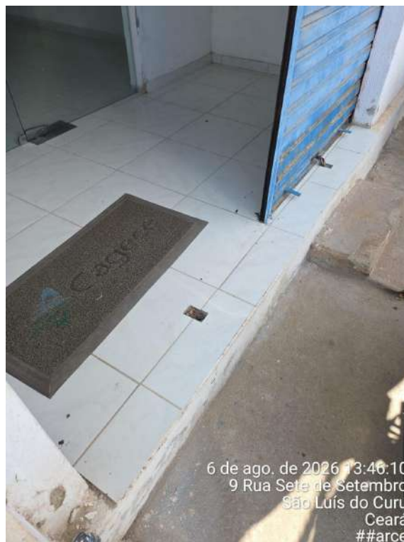
Foto 2 - Núcleo Operacional de São Luís do Curu: inexistência de condições adequadas de acessibilidade para cadeirantes.
