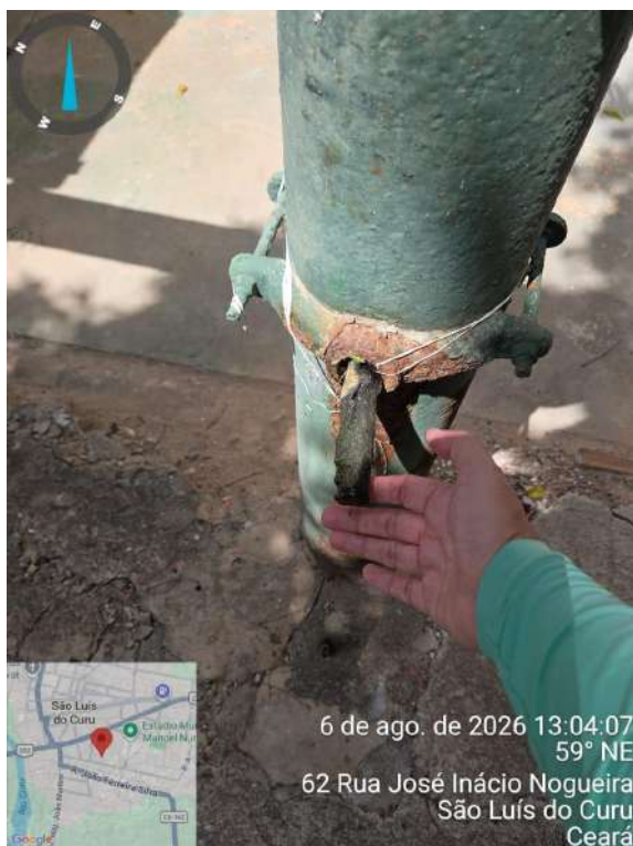
Foto 88 - Adutora da ETA: tubulação com corrosão e perfuração, apresentando reparo improvisado e vazamento, além de piso deteriorado.
