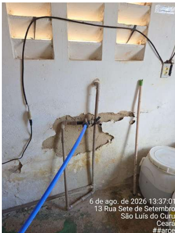
Foto 7 - Casa de química da ETA: instalações elétricas e hidráulicas precárias, com deterioração do revestimento e sinais de umidade na parede.
