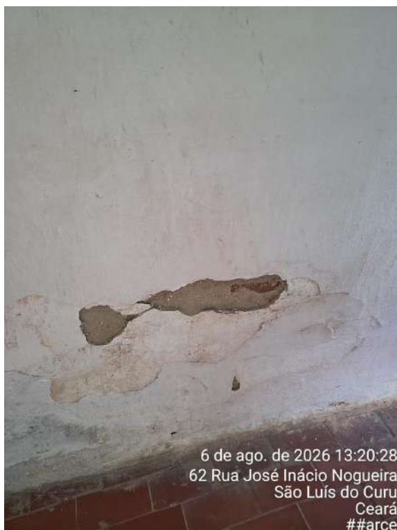
Foto 44 - EEAT-01: deterioração do revestimento das paredes.
