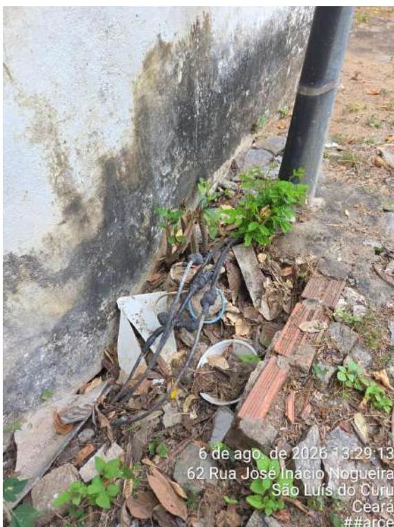
Foto 21 - Casa de bombas de lavagem dos filtros da ETA: fiação elétrica exposta e disposta inadequadamente no solo, com acúmulo de resíduos e vegetação no entorno, além de sinais de umidade na parede.
