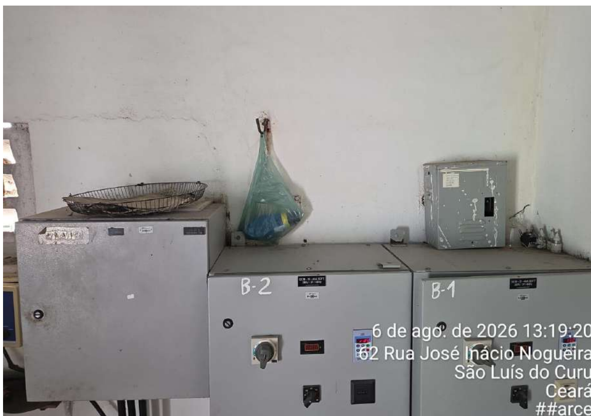
Foto 40 - EEAT-01: quadros elétricos utilizados como superfície de apoio para armazenamento inadequado de materiais e objetos diversos.
