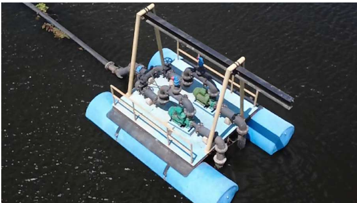
Foto 106 - Captação do Açude Frios: ausência de proteção/cobertura dos conjuntos motobomba e componentes eletromecânicos, plataforma flutuante sem meio seguro de embarque/desembarque para operação e manutenção, guarda-corpo incompleto na plataforma.
