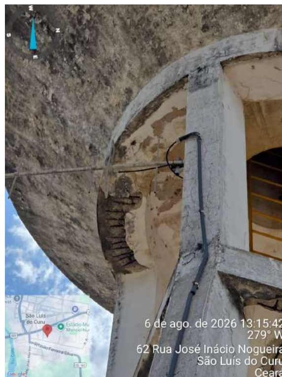
Foto 60 - REL-01: desprendimento do revestimento, exposição das armaduras e sinais de deterioração do concreto.
