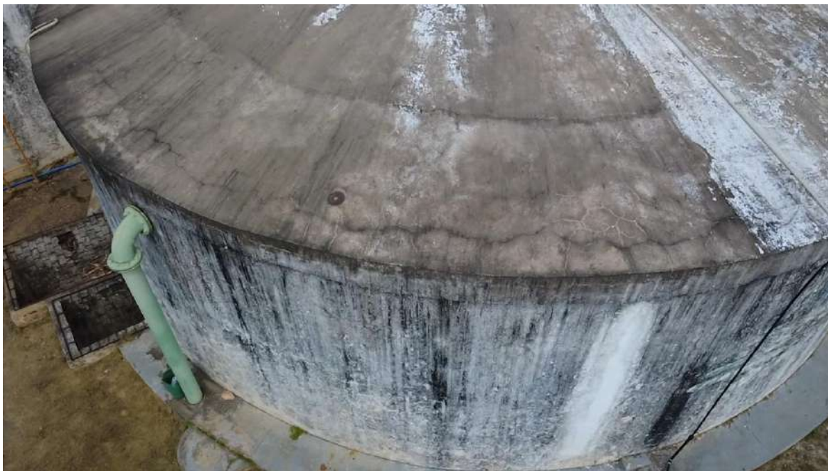
Foto 52 - RAP-01: patamar superior desprovido de guarda-corpo, sinais de umidade e deterioração do revestimento da parede, associado à presença de fissuras.
