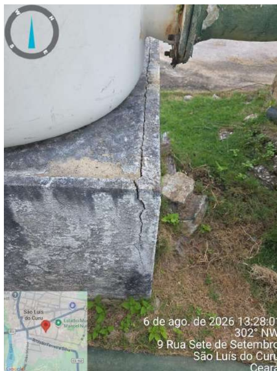
Foto 22 - Torre de nível 1 da ETA: estrutura de apoio com fissura.
