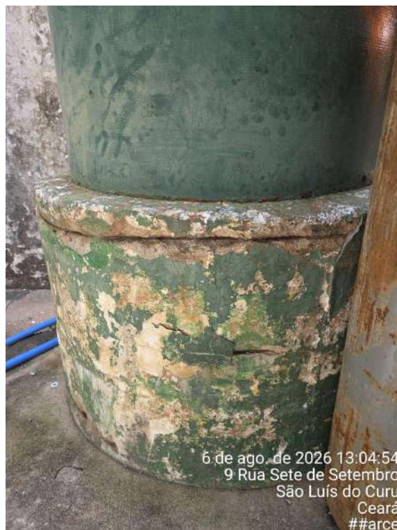
Foto 87 - Torre de nível 2 da ETA: estrutura de apoio deteriorada, além de armaduras expostas e corroídas.
