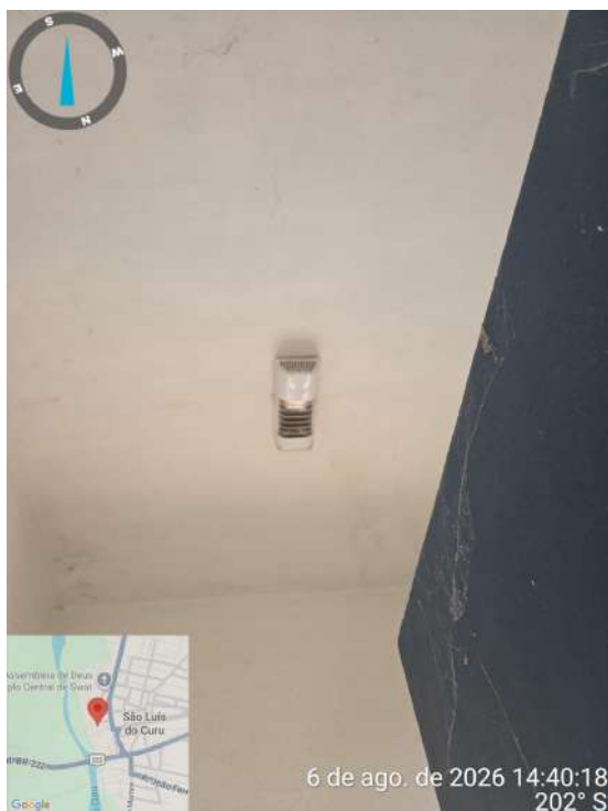
Foto 133 - EEE-01: ausência de iluminação artificial na casa dos quadros de comando.
