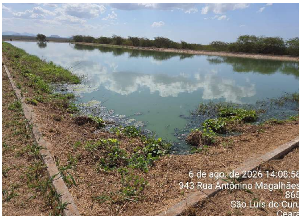
Foto 116 - Lagoa facultativa: presença de vegetação e de sujeira, reduzindo a área útil de tratamento.
