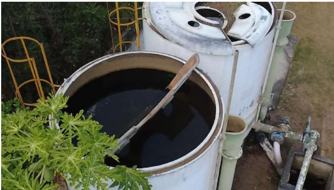
Foto 78 - Filtros de fibra (F-03 e F-04) da ETA: tampas dos filtros danificadas, com comprometimento da integridade e do adequado fechamento das aberturas superiores.
