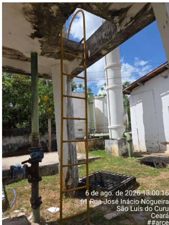
Foto 62 - REL-01: escada fixa sem guarda-corpo tipo gaiola, associada a sinais de umidade e deterioração do revestimento da estrutura de concreto.
