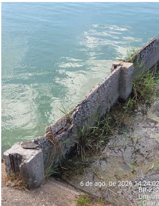
Foto 128 - Lagoa de maturação: chicana, com deterioração e perda parcial de sua integridade estrutural, além da presença de vegetação.
