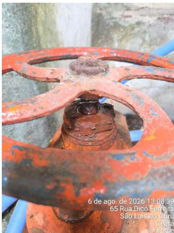
Foto 76 - Filtros de alvenaria (F-01 e F-02) da ETA: registro da tubulação com vazamento.
