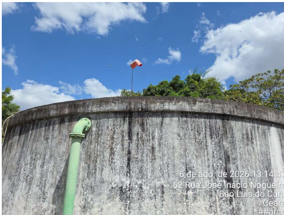
Foto 50 - RAP-01: patamar superior desprovido de guarda-corpo, associado a sinais de umidade e deterioração do revestimento da parede.
