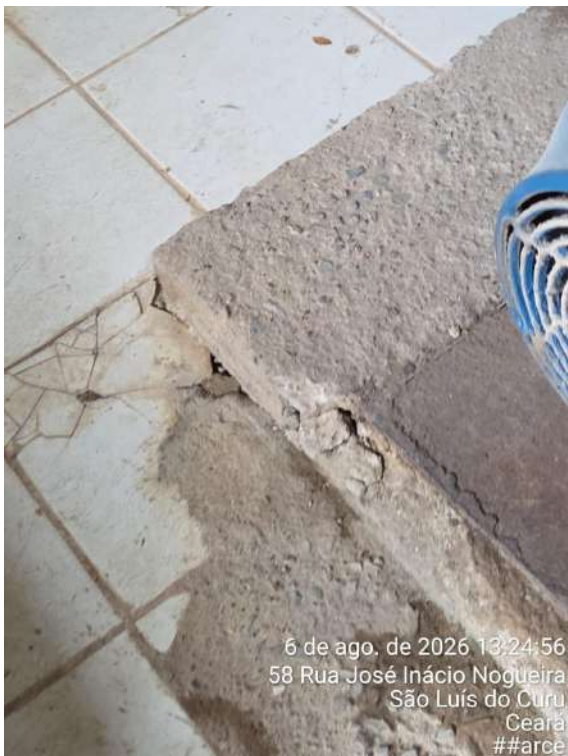
Foto 28 - EEAT-02: base de concreto do conjunto motobomba com fissuras, desagregação e deterioração superficial, além de revestimento cerâmico adjacente danificado.
