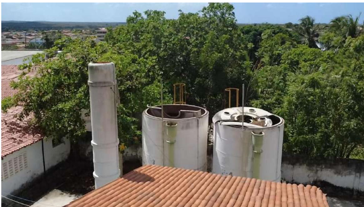
Foto 80 - Filtros de fibra (F-03 e F-04) da ETA: tampas dos filtros danificadas, com comprometimento da integridade e do adequado fechamento das aberturas superiores.
