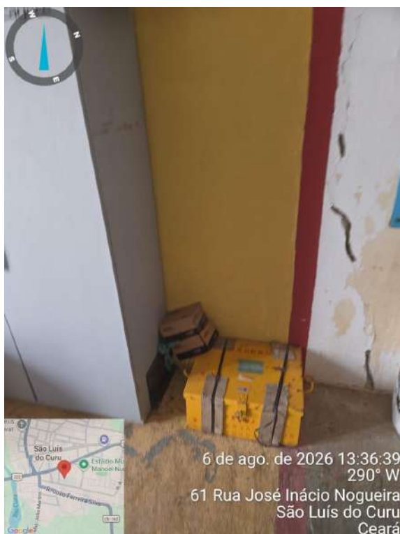
Foto 9 - Casa de química da ETA: rachaduras, fissuras e deterioração do revestimento da parede, associadas ao armazenamento inadequado de materiais diretamente no piso.
