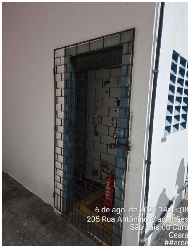
Foto 135 - EEE-01: casa dos quadros de comando sem identificação.
