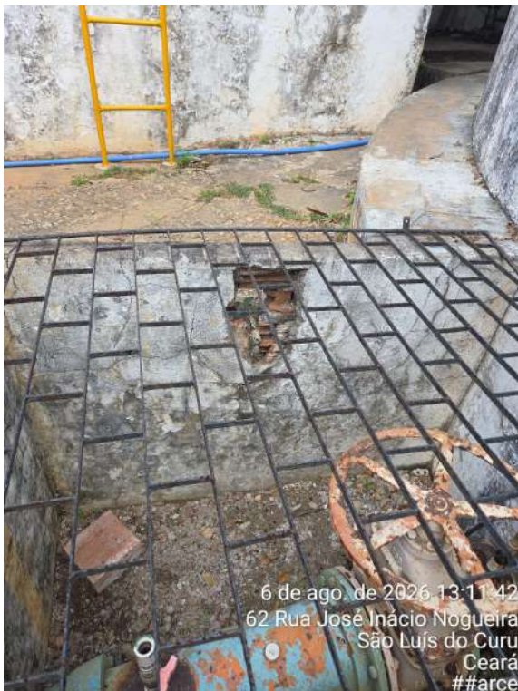
Foto 57 - RAP-01: grade de proteção da caixa de manobra, tubulação e componentes com sinais de oxidação, além de revestimento da parede de apoio danificado.
