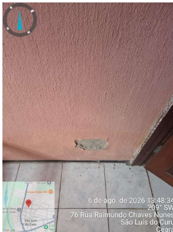
Foto 4 - Almojarifado do Núcleo Operacional de São Luís do Curu: desprendimento do revestimento da parede.
