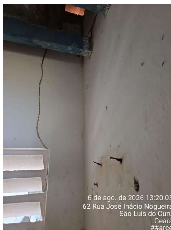
Foto 42 - EEAT-01: elementos metálicos salientes na parede e presença de caminhos/estruturas indicativas de infestação por cupins no banheiro.
