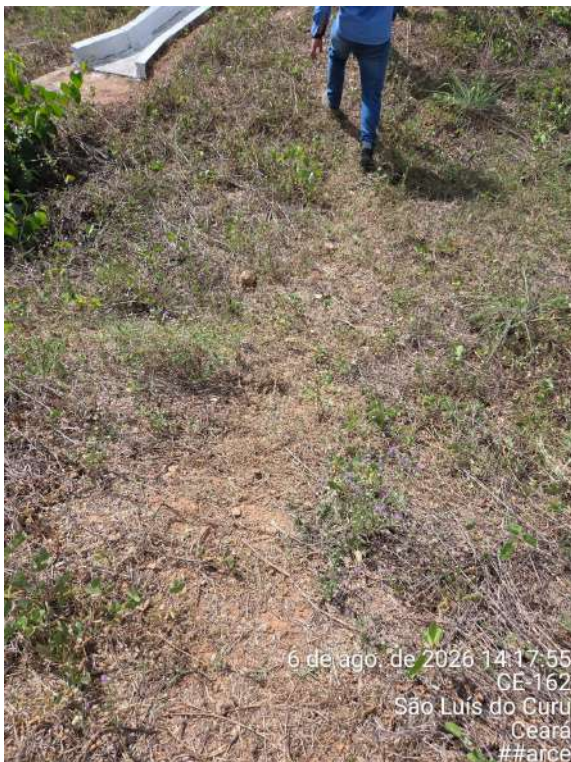
Foto 114 - Área de circulação e acesso operacional da lagoa facultativa e de maturação: acesso dificultado às lagoas, com ausência de caminho adequado e presença de terreno irregular com vegetação.
