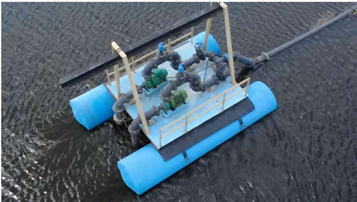
Foto 105 - Captação do Açude Frios: ausência de proteção/cobertura dos conjuntos motobomba e componentes eletromecânicos, plataforma flutuante sem meio seguro de embarque/desembarque para operação e manutenção, guarda-corpo incompleto na plataforma.
