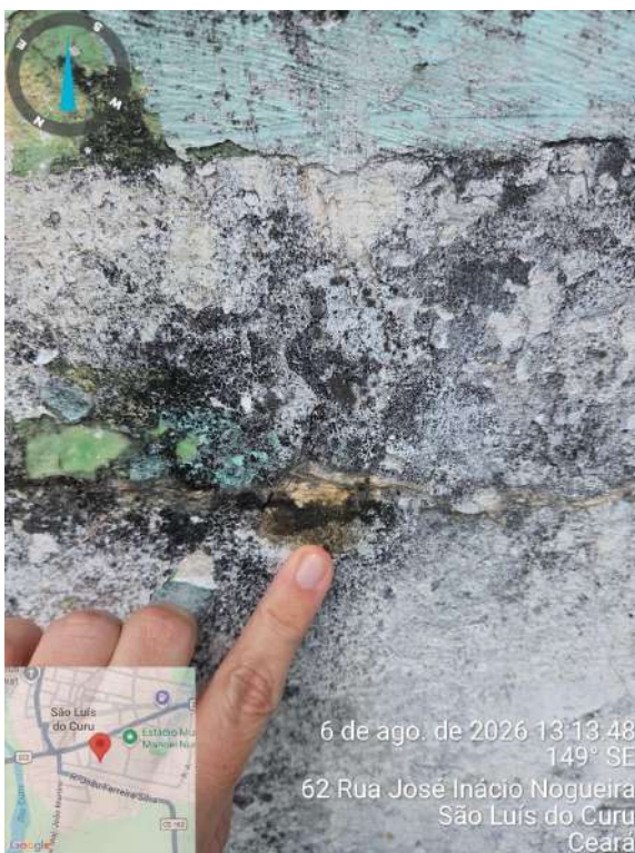
Foto 55 - RAP-01: sinais de umidade na parede.
