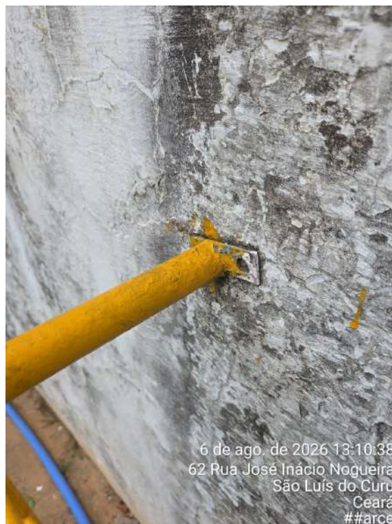
Foto 75 - Filtros de alvenaria (F-01 e F-02) da ETA: escada de acesso ao patamar superior sem fixação.
