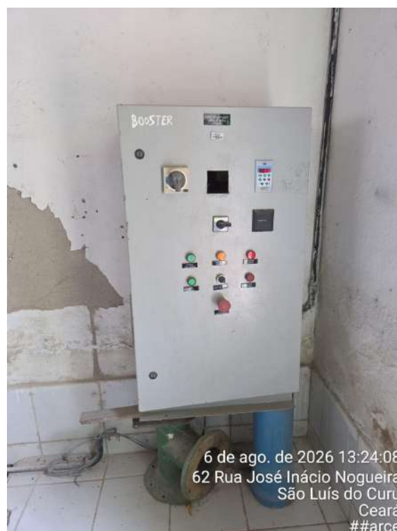
Foto 25 - EEAT-02: quadro elétrico com componentes de comando danificados ou ausentes, fios expostos e peça metálica disposta inadequadamente sobre o piso, além de deterioração do revestimento nas paredes.
