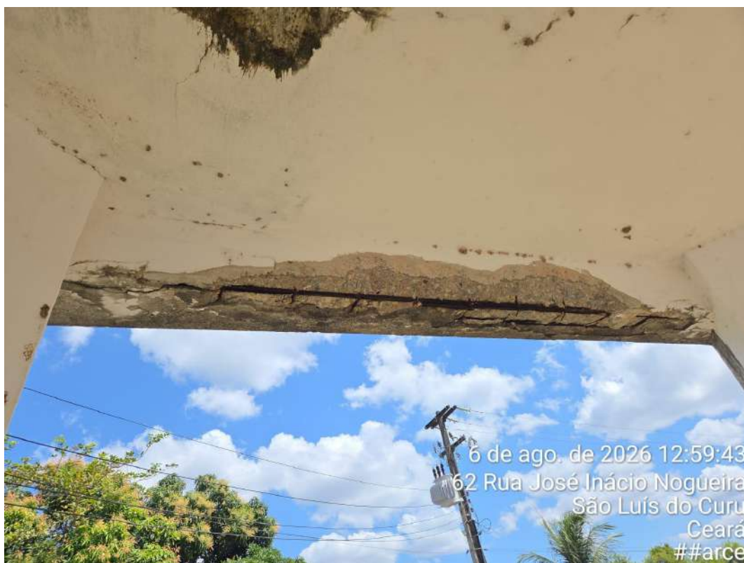
Foto 63 - REL-01: desprendimento do revestimento, exposição das armaduras e sinais de deterioração do concreto.
