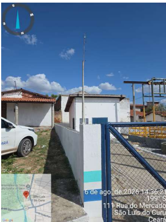
Foto 129 - EEE-01: muro perimetral com altura insuficiente, facilitando o acesso não autorizado à unidade.
