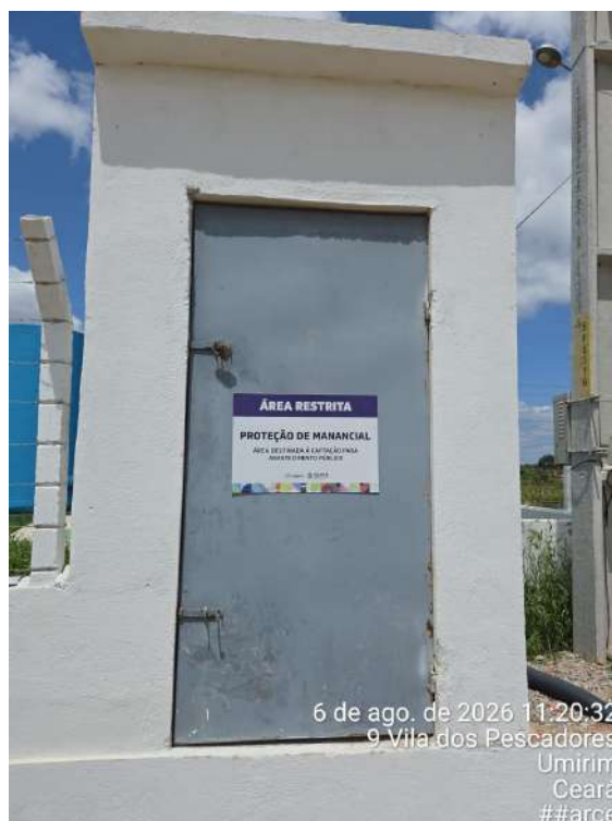
Foto 103 - Captação do Açude Frios: porta de acesso a casa de comando sem sinalização de risco elétrico.
