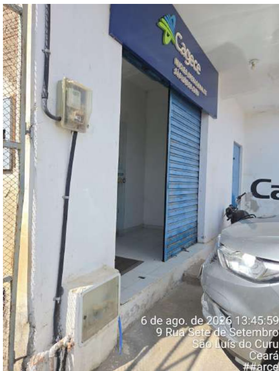
Foto 1 - Núcleo Operacional de São Luís do Curu: acesso ao atendimento com desnível e sem elementos adequados de acessibilidade para pessoas com deficiência ou mobilidade reduzida.
