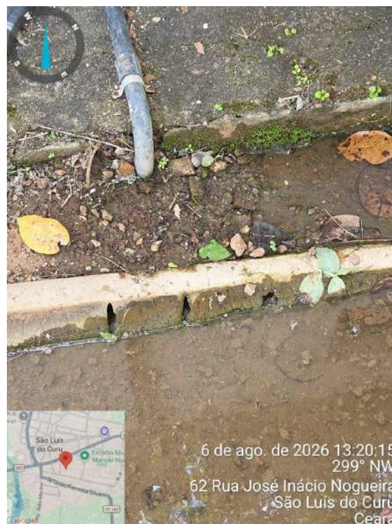
Foto 45 - Tubulação de lavagem dos tanques de produto químico da ETA: acúmulo de água no terreno indicativo de vazamento.
