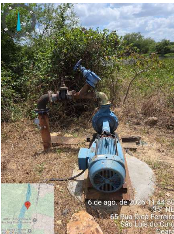
Foto 102 - Captação do Rio Curu: conjunto motobomba com corrosão, fiação exposta, ausência de proteção adequada no acoplamento, além de deterioração da base e do piso adjacente.
