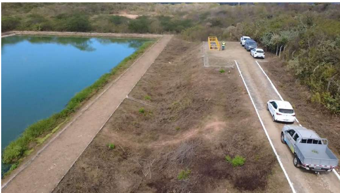
Foto 122 - Lagoa facultativa: presença de vegetação e de sujeira, reduzindo a área útil de tratamento, além de ausência de cercamento no perímetro da lagoa, permitindo livre acesso à área.
