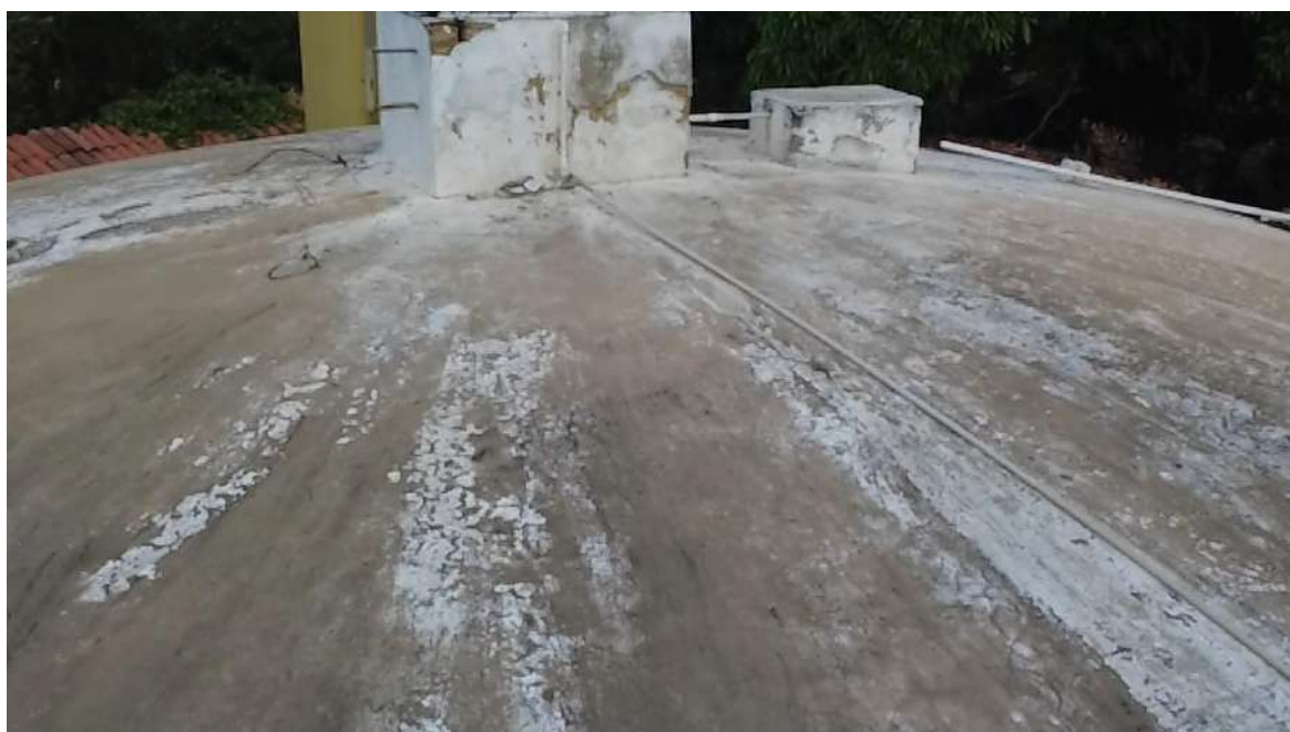
Foto 51 - RAP-01: patamar superior desprovido de guarda-corpo, sinais de umidade e deterioração do revestimento, além de armadura da caixa de inspeção/acesso exposta.
