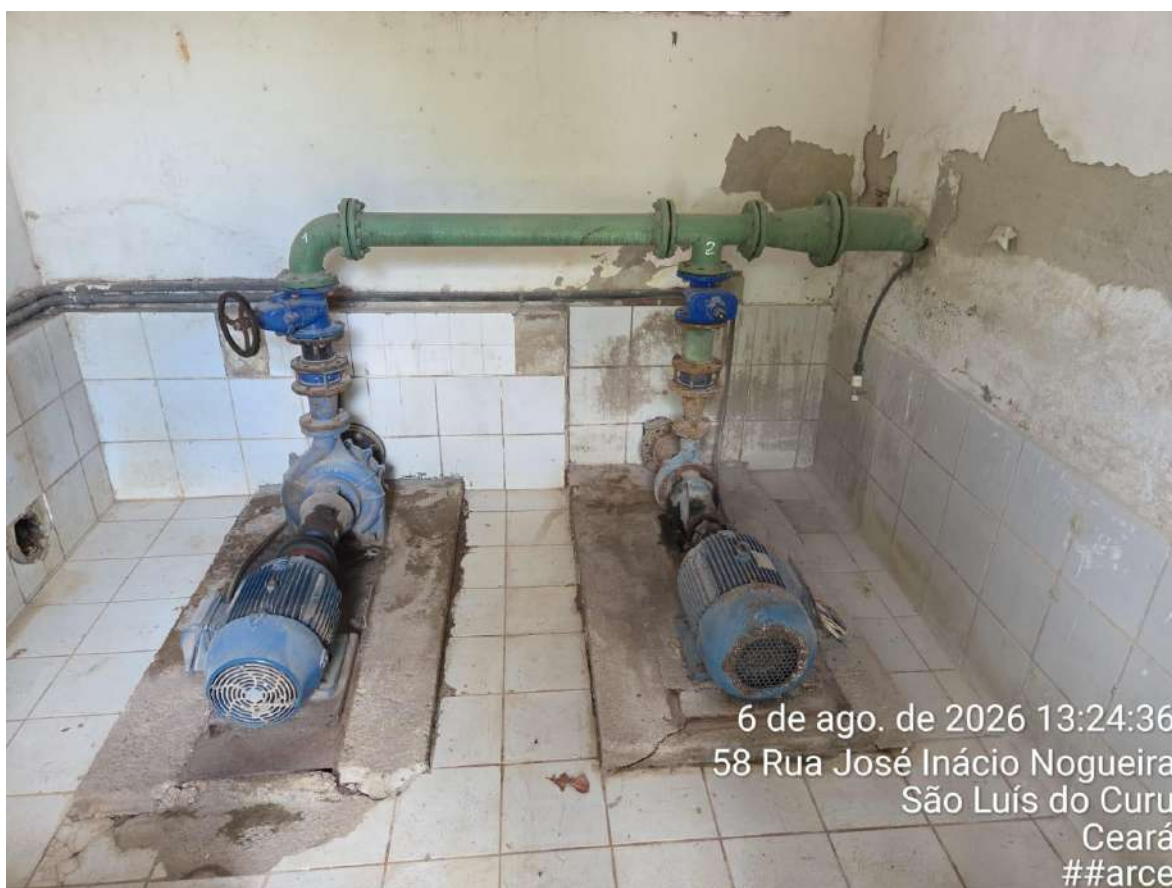
Foto 26 - EEAT-02: conjuntos motobomba e conexões com sinais de corrosão e desgaste, além de deterioração do revestimento das paredes e do piso.
