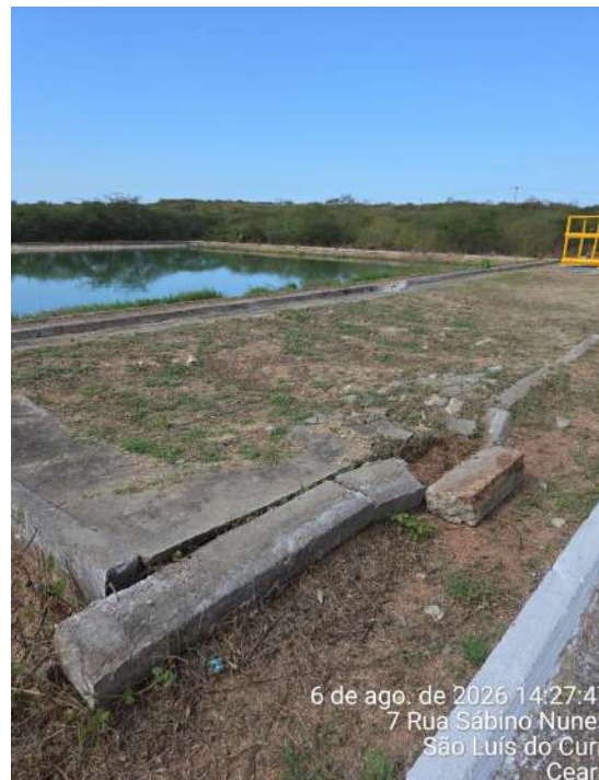
Foto 113 - Área de circulação e acesso operacional da lagoa facultativa e maturação: piso adjacente à lagoa facultativa danificado, com placas de concreto quebradas, deslocadas e desníveis na superfície.
