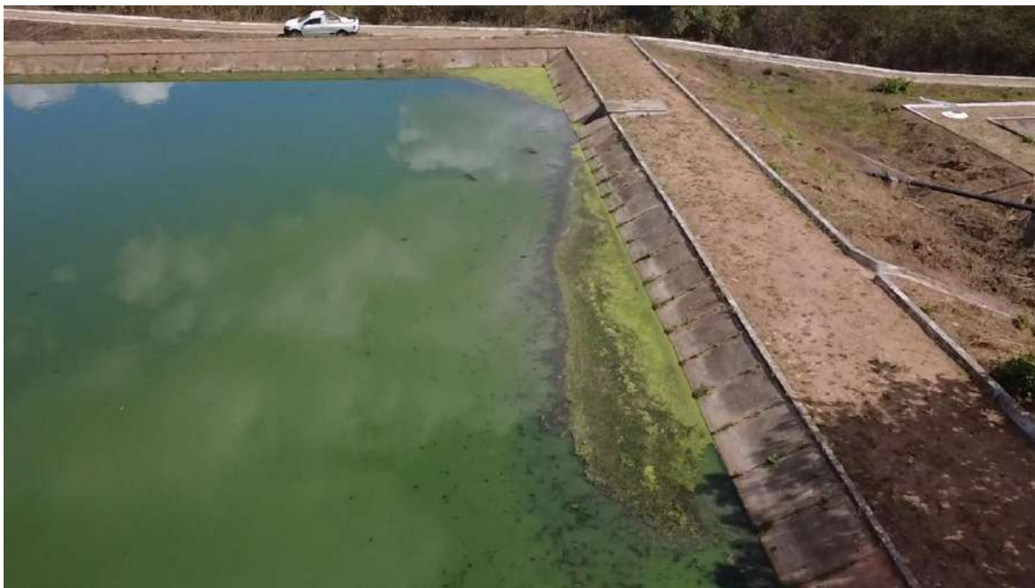
Foto 121 - Lagoa facultativa: presença de vegetação e de sujeira, reduzindo a área útil de tratamento.
