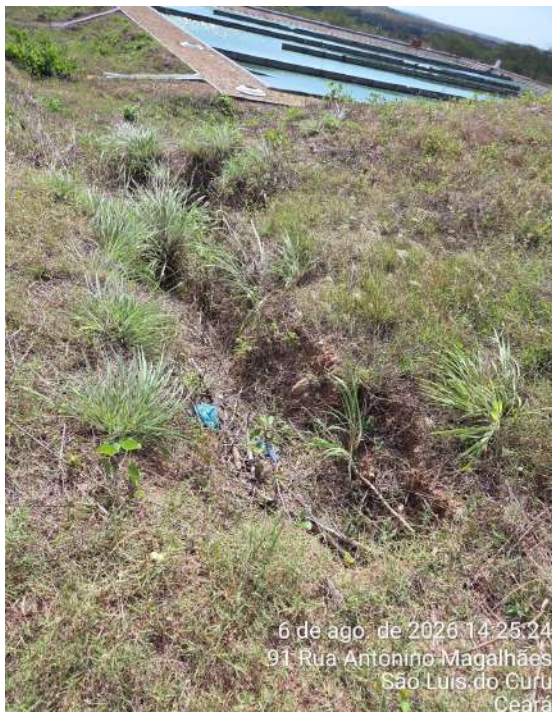
Foto 112 - Área de circulação e acesso operacional da lagoa facultativa e maturação: processo erosivo no solo, com formação de sulcos e perda de material superficial, além da existência de resíduos e vegetação.
