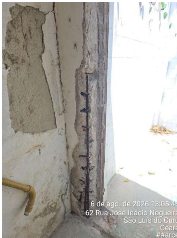
Foto 85 - Casa de cloro da ETA: pilar com deterioração do revestimento, com armadura exposta e sinais de corrosão.
