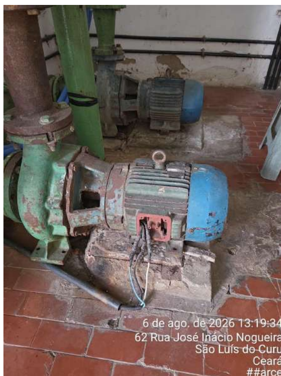
Foto 39 - EEAT-01: conjunto motobomba com corrosão, fiação exposta, ausência de proteção adequada no acoplamento e deterioração da base e do piso adjacente.
