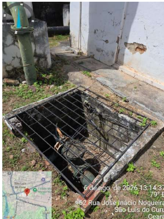
Foto 47 - Área de circulação e acesso operacional da ETA: estrutura de apoio da grade de proteção danificada e deteriorada.
