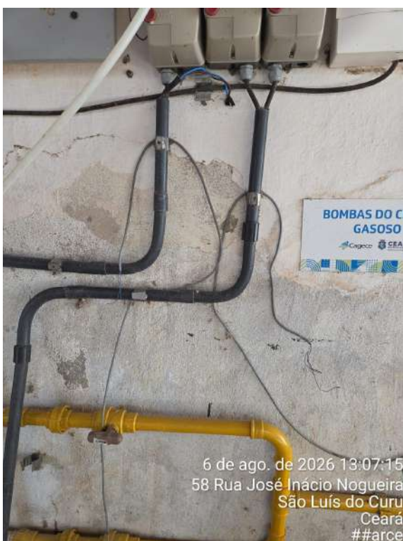
Foto 81 - Casa de cloro da ETA: fiação elétrica exposta e sem proteção adequada.
