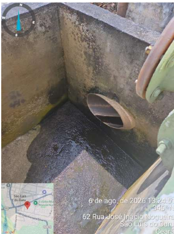
Foto 36 - Filtro 3 da ETA: caixa de passagem desprovida de grade ou tampa de proteção e água escoada oriunda de vazamentos.
