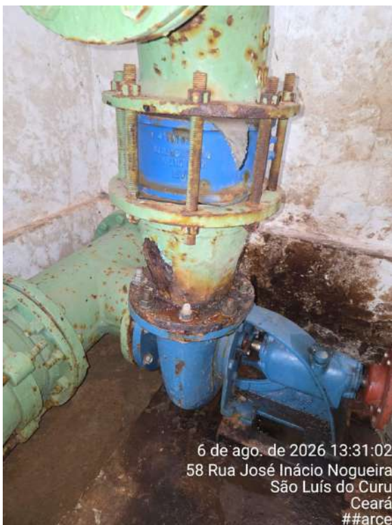
Foto 17 - Casa de bombas de lavagem dos filtros da ETA: tubulações e conexões com corrosão acentuada e indícios de vazamento, além de sinais de umidade nas paredes.
