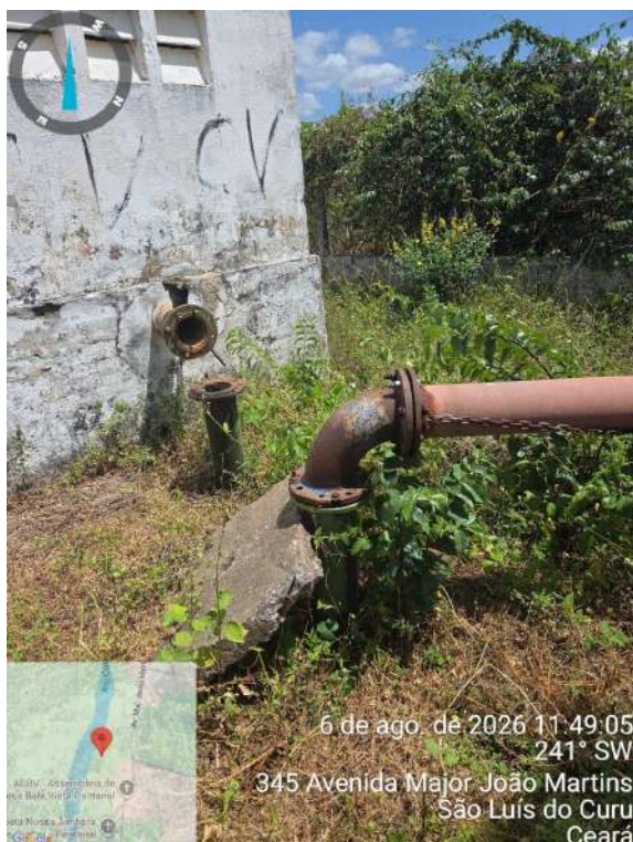
Foto 98 - Poço de reunião - Captação do Rio Curu: tubulação e conexões metálicas com corrosão e desativadas, estrutura de concreto apoiada de forma inadequada, além da presença de vegetação.
