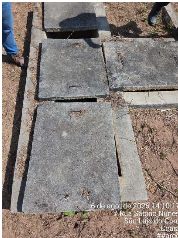
Foto 125 - Lagoa facultativa: tampas das caixas de inspeção com dimensões excessivas ou incompatíveis com as aberturas, comprometendo a vedação.
