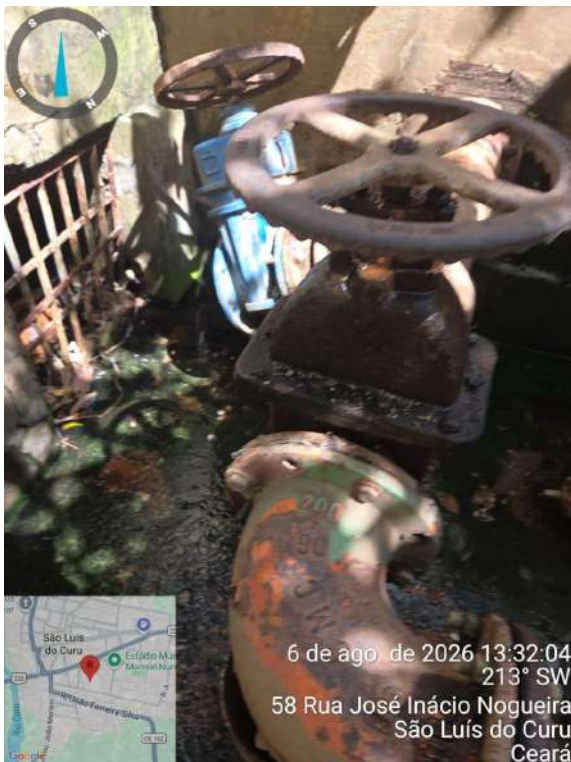
Foto 14 - Tubulação e registro dos filtros de alvenaria (F-01 e F-02) da ETA: sinais de corrosão e vazamento, apresentando componentes desmontados e dispostos inadequadamente sobre o piso, além de acúmulo de água e resíduos no local.
