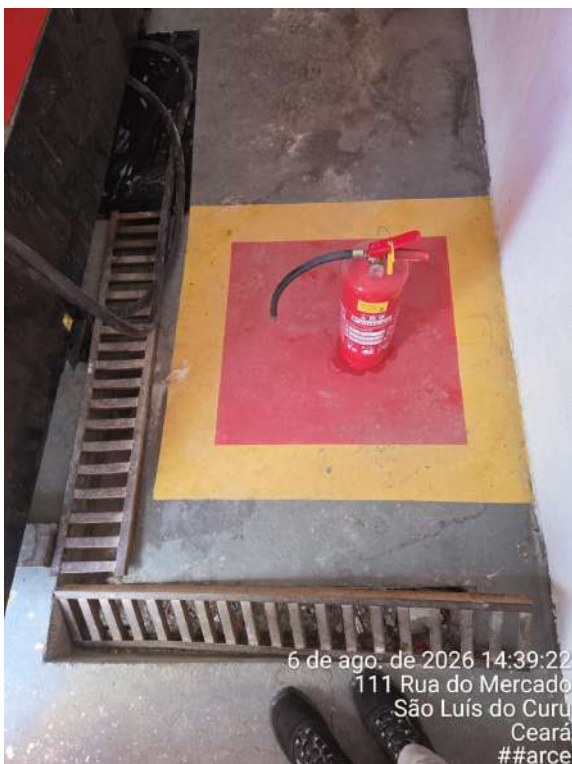
Foto 131 - EEE-01: grade da canaleta de drenagem com dimensões incompatíveis com as aberturas, resultando em posicionamento inadequado e comprometendo a circulação segura de pessoas.
