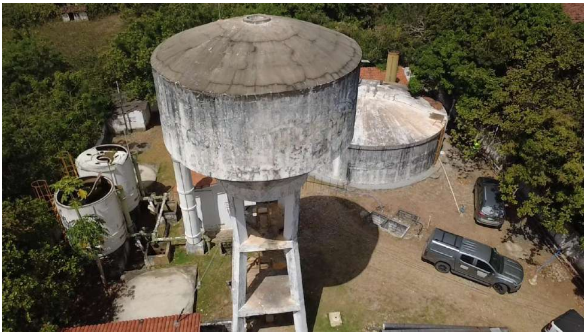
Foto 64 - REL-01: cobertura e paredes com fissuras e sinais de deterioração, ausência de guarda-corpo em áreas elevadas de inspeção/manutenção.
