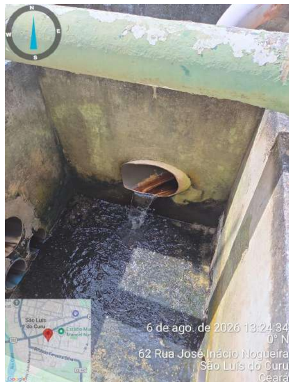
Foto 33 - Filtro de fibra 4 (F-04) da ETA: caixa de passagem desprovida de grade ou tampa de proteção e água escoada oriunda de vazamentos.
