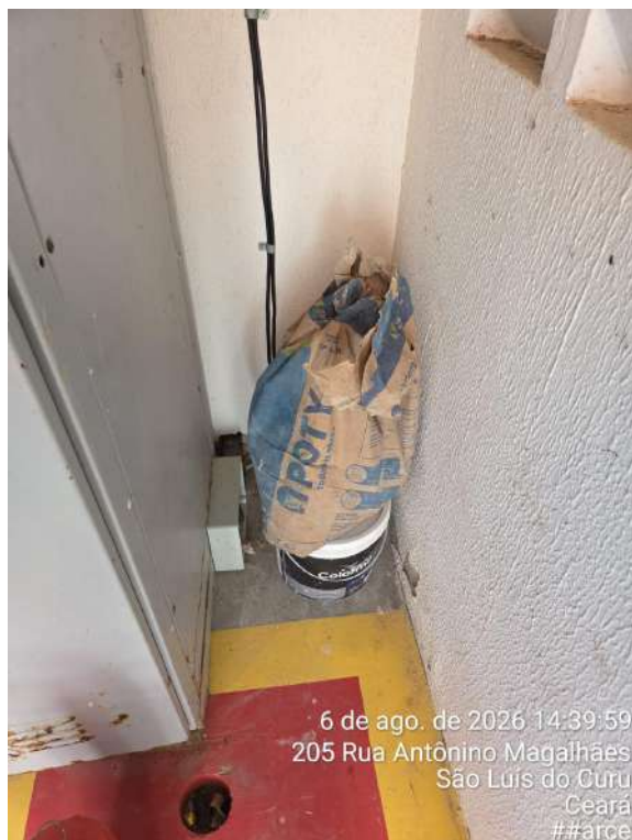
Foto 132 - EEE-01: armazenamento inadequado de materiais junto ao painel elétrico.
