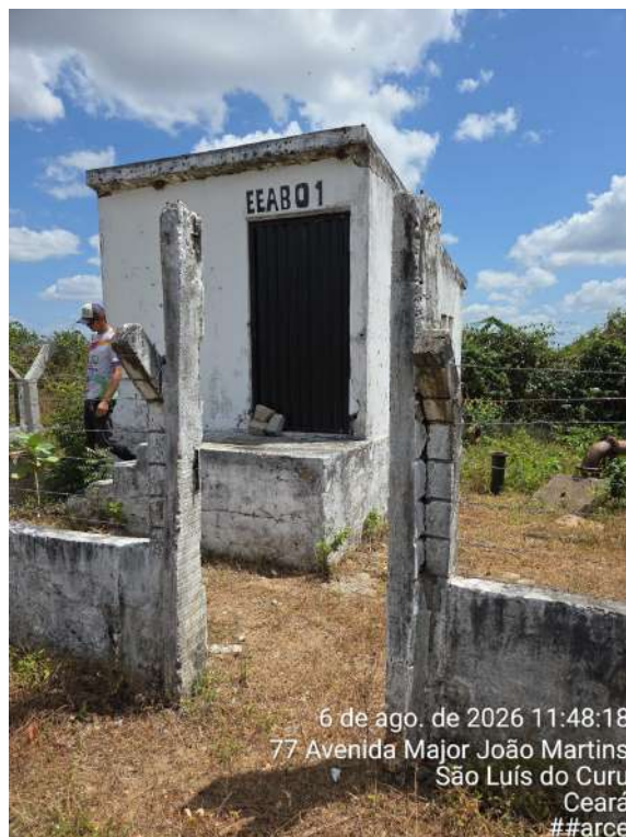
Foto 97 - EEAB-01: acesso à unidade sem identificação e sem portão, permitindo entrada não controlada.
