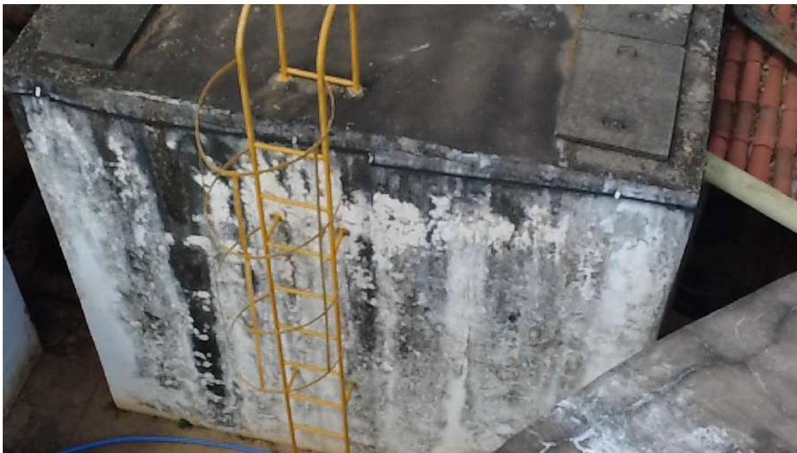
Foto 72 - Filtros de alvenaria (F-01 e F-02) da ETA: patamar superior desprovido de guarda-corpo, associado a sinais de umidade e deterioração do revestimento.
