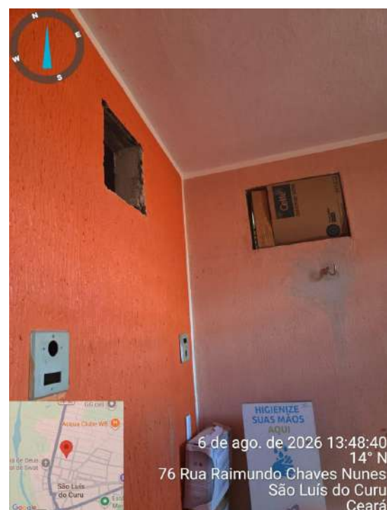
Foto 5 - Almojarifado do Núcleo Operacional de São Luís do Curu: aberturas na alvenaria sem vedação e acabamento adequados.
