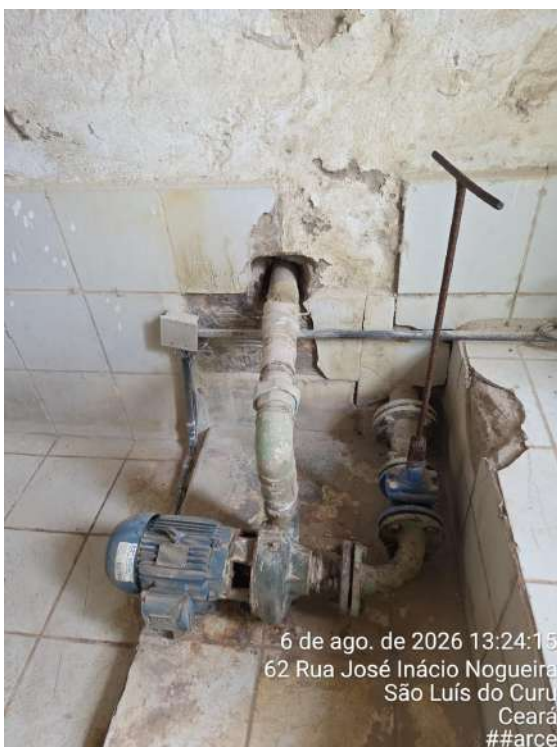
Foto 30 - EEAT-02: conjunto motobomba e tubulações com sinais de corrosão e deterioração, além de revestimento de paredes e piso danificado, com aberturas e acabamento inadequado.
