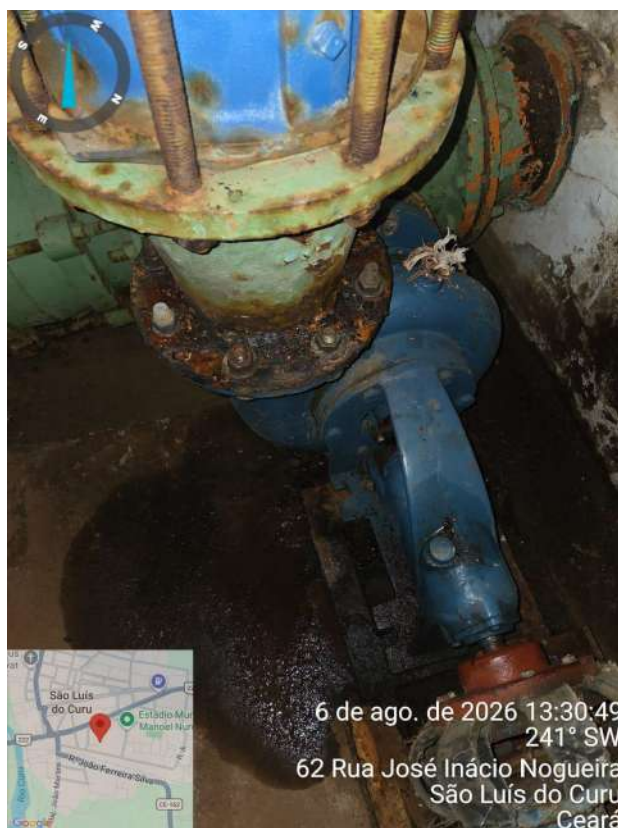
Foto 19 - Casa de bombas de lavagem dos filtros da ETA: tubulações e conexões com corrosão acentuada e indícios de vazamento, além de sinais de umidade nas paredes.
