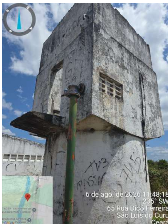
Foto 99 - Poço de reunião - Captação do Rio Curu: desativado, sem desmobilização adequada, e estrutura em avançado estado de deterioração.
