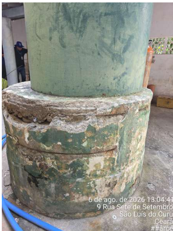
Foto 86 - Torre de nível 2 da ETA: estrutura de apoio deteriorada, além de armaduras expostas e corroídas.
