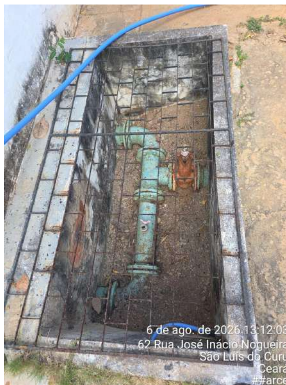
Foto 56 - RAP-01: grade de proteção da caixa de manobra com sinais de corrosão e deformação, tubulação e componentes com sinais de oxidação e sem dispositivo manual de acionamento do registro (volante/manivela).
