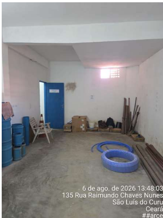
Foto 3 - Almojarifado do Núcleo Operacional de São Luís do Curu: iluminação insuficiente no ambiente, comprometendo a adequada visibilidade e segurança no local.
