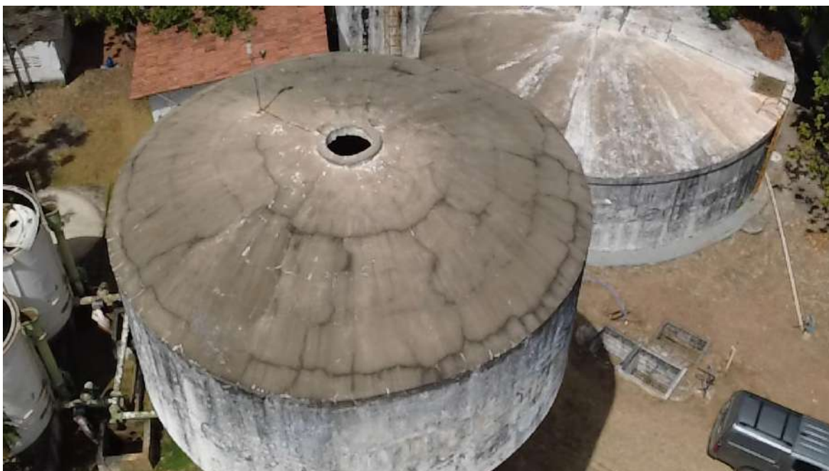
Foto 65 - REL-01: cobertura com fissuras e sinais de deterioração, ausência de guarda-corpo e abertura superior sem proteção ou vedação.
