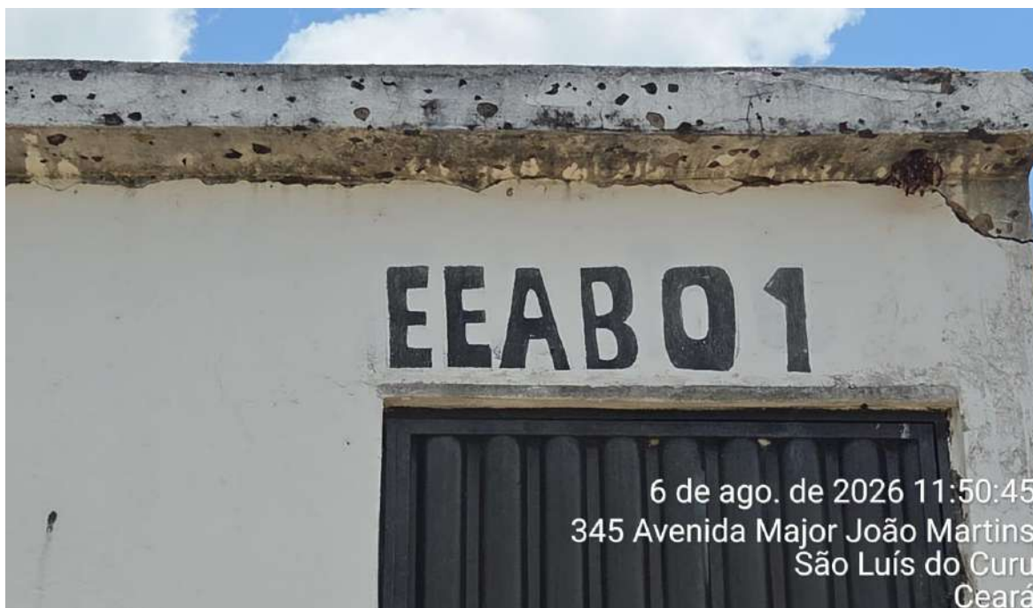
Foto 94 - EEAB-01: laje de concreto deteriorada, com desagregação superficial e fissuras, além de presença de ninho de marimbondos, impedindo o acesso ao interior da estação em virtude da ocorrência de ataques.
