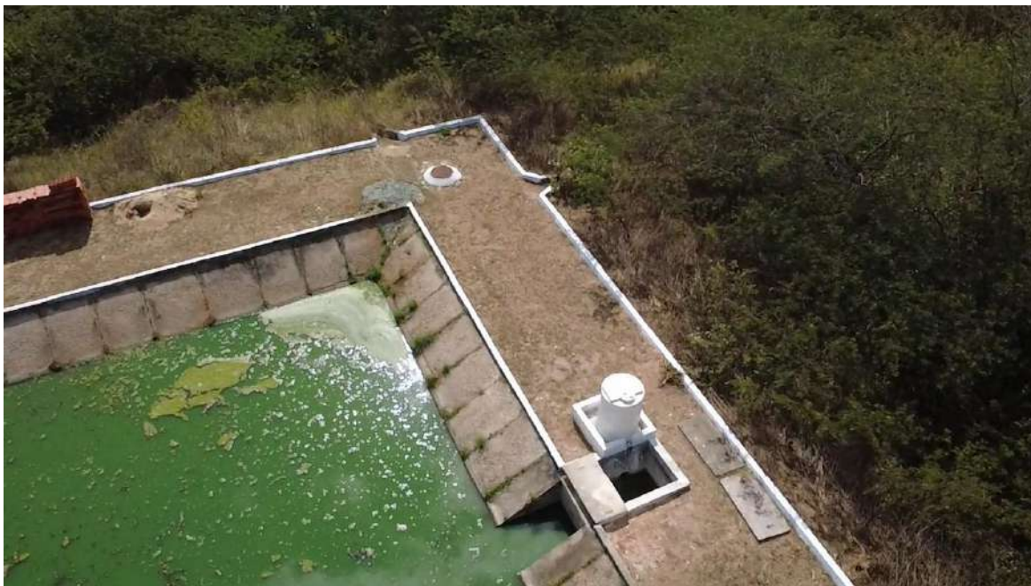
Foto 126 - Lagoa de maturação: acúmulo de sobrenadante e ausência de cercamento no perímetro da lagoa, permitindo livre acesso à área.
