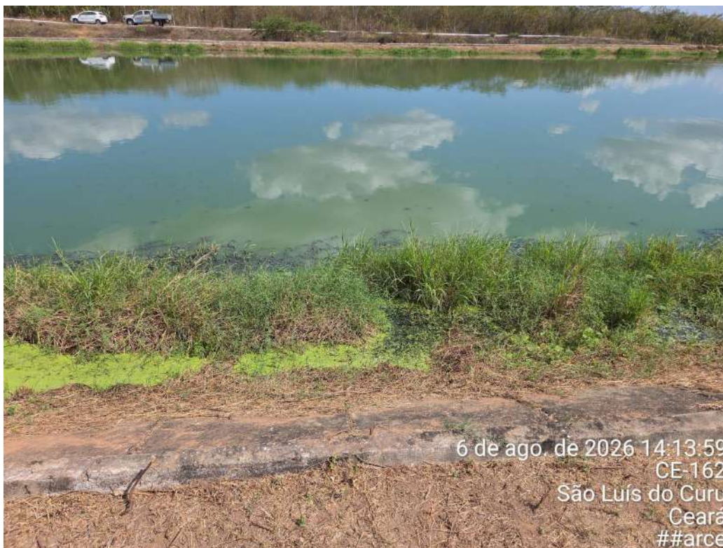
Foto 117 - Lagoa facultativa: presença de vegetação e de sujeira, reduzindo a área útil de tratamento.
