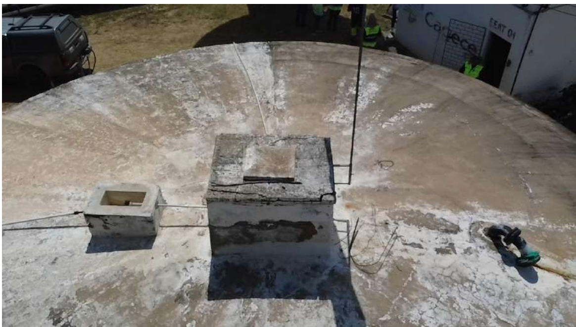
Foto 54 - RAP-01: suspiro oxidado e sem tela de proteção, patamar superior desprovido de guarda-corpo, sinais de umidade e deterioração do revestimento, além de armadura da caixa de inspeção/acesso exposta.
