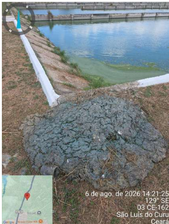
Foto 110 - Área de circulação e acesso operacional da lagoa facultativa e maturação: disposição inadequada de sobrenadante proveniente da lagoa de maturação diretamente sobre o solo, com acúmulo de material e potencial risco de contaminação.
