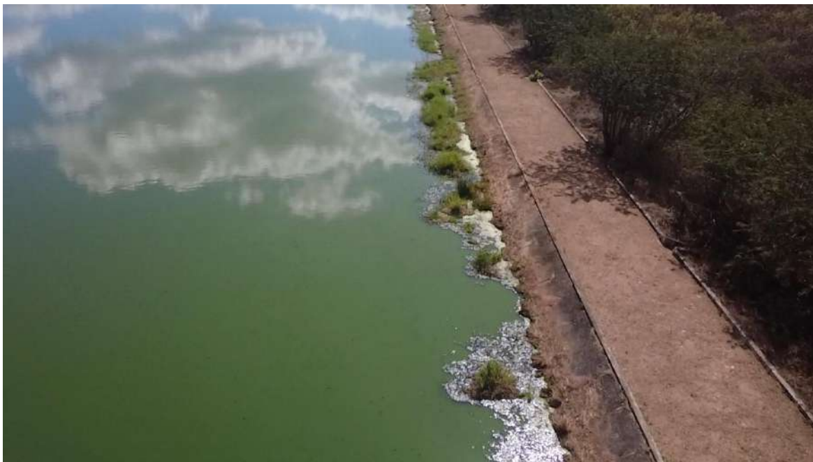
Foto 119 - Lagoa facultativa: presença de vegetação e de sujeira, reduzindo a área útil de tratamento, além de ausência de cercamento no perímetro da lagoa, permitindo livre acesso à área.
