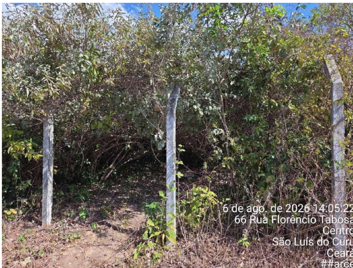
Foto 107 - Área de circulação e acesso operacional da lagoa facultativa e de maturação: cercamento incompleto, com ausência de arame entre os mourões e excesso de vegetação.
