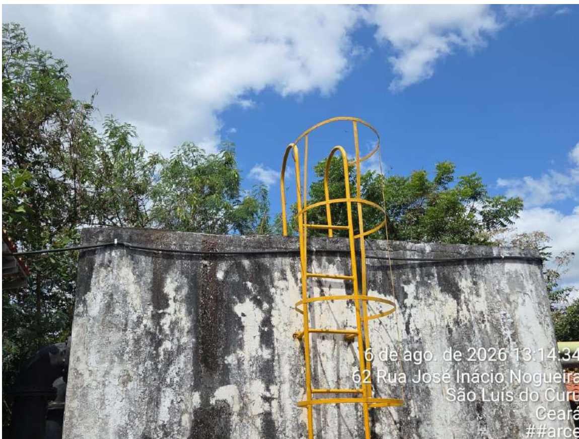
Foto 71 - Filtros de alvenaria (F-01 e F-02) da ETA: patamar superior desprovido de guarda-corpo, associado a sinais de umidade e deterioração do revestimento da parede.
