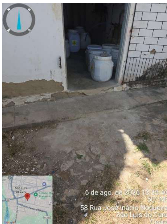
Foto 10 - Casa de química da ETA: acesso inadequado ao ambiente, com desnível, piso deteriorado e desprendimento do revestimento da fachada.
