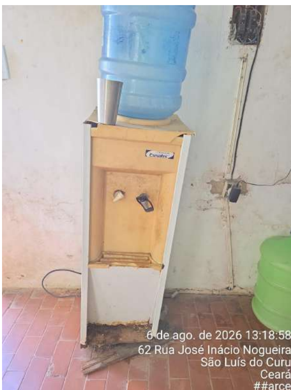
Foto 38 - EEAT-01: bebedouro em condições precárias de conservação e higiene, fiação aparente e quadro elétrico sem tampa de proteção.
