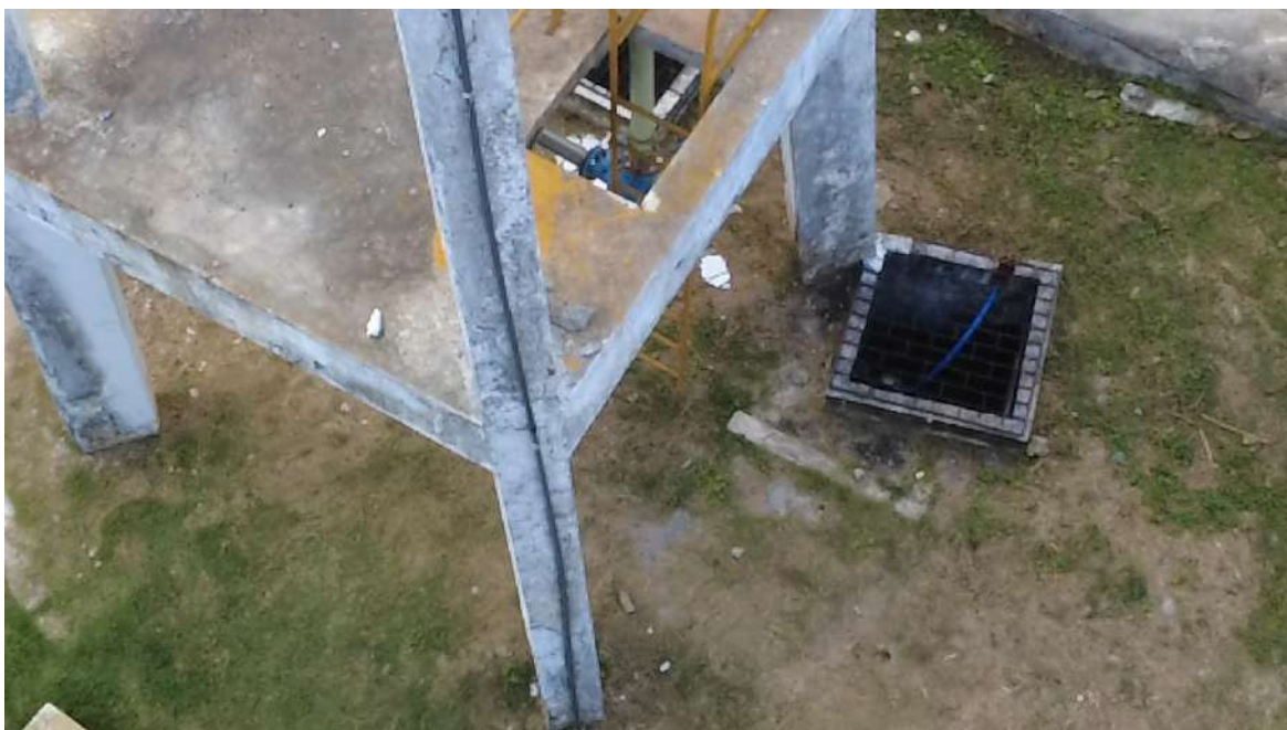
Foto 70 - REL-01: plataforma intermediária e escada fixa sem guarda-corpo, com presença de resíduos e fragmentos do revestimento do REL desprendidos, além de fissuras nos pilares.
