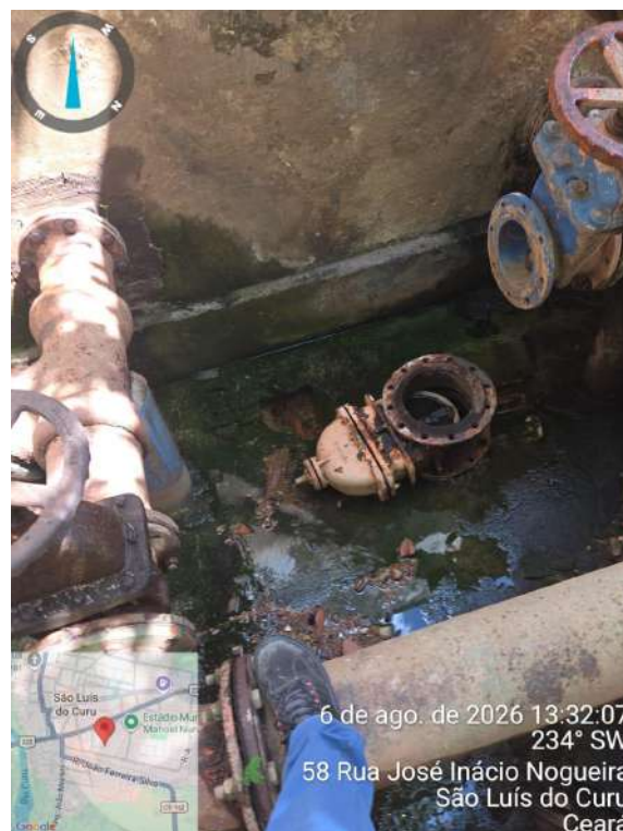
Foto 13 - Tubulações e conexões hidráulicas dos filtros de alvenaria (F-01 e F-02) da ETA: sinais de corrosão, apresentando componentes desmontados e dispostos inadequadamente sobre o piso, além de acúmulo de água e resíduos no local.
