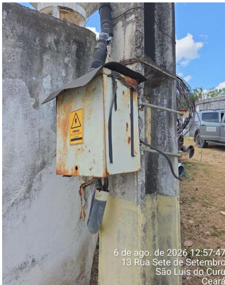
Foto 93 - Quadro de distribuição de energia elétrica da ETA: quadro elétrico com corrosão, fiação exposta e proteção inadequada.
