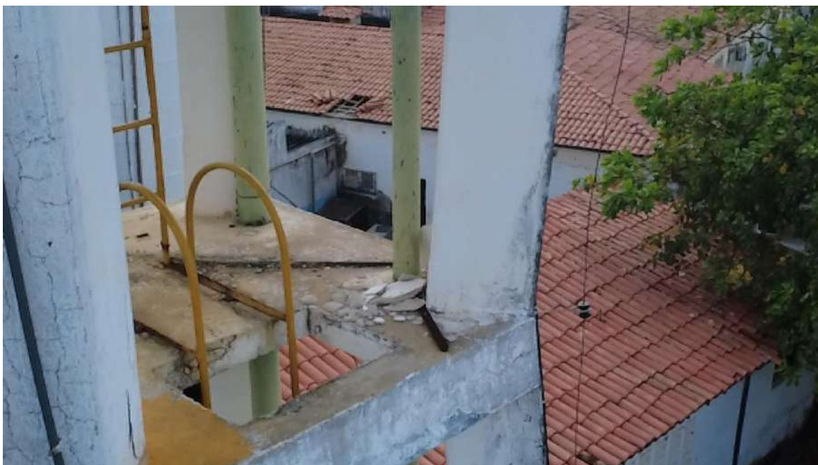
Foto 69 - REL-01: plataforma intermediária e escada fixa sem guarda-corpo, com presença de resíduos e fragmentos do revestimento do REL desprendidos, além de fissuras nos pilares.
