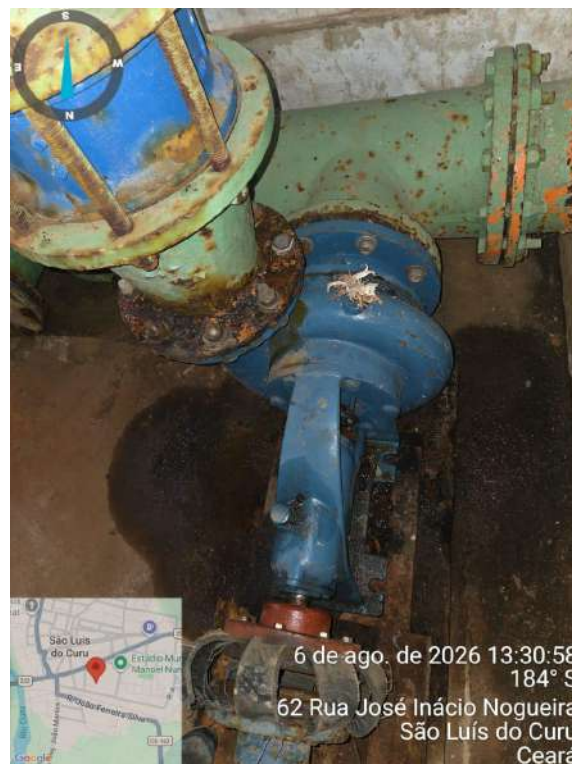
Foto 18 - Casa de bombas de lavagem dos filtros da ETA: tubulações e conexões com corrosão acentuada e indícios de vazamento.
