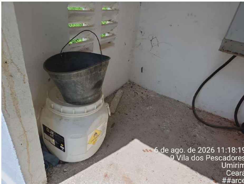
Foto 104 - Captação do Açude Frios: armazenamento inadequado de produto químico e presença de sujidades no piso da casa de comando.
