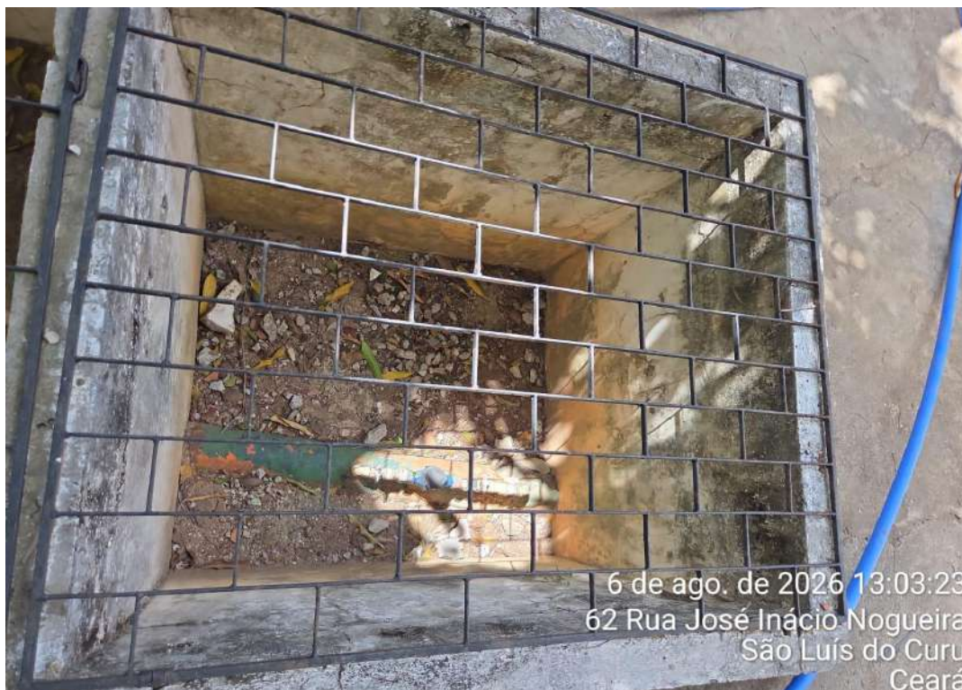
Foto 90 - Adutora da ETA: caixa de passagem sem escada de acesso, paredes com rachaduras e com sinais de deterioração do revestimento.
