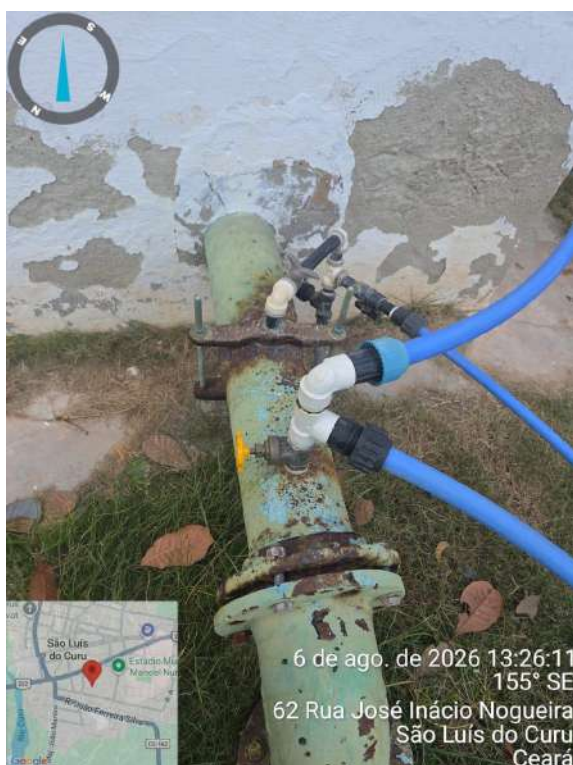
Foto 24 - EEAT-02: tubulação e conexões com oxidação e desprendimento do revestimento da parede adjacente.
