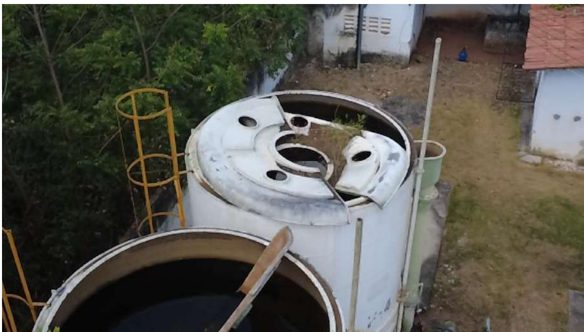
Foto 79 - Filtros de fibra (F-03 e F-04) da ETA: tampas dos filtros danificadas, com comprometimento da integridade e do adequado fechamento das aberturas superiores.
