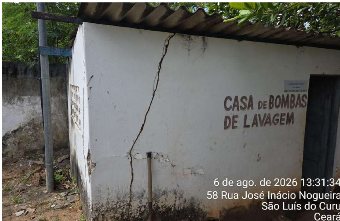
Foto 16 - Casa de bombas de lavagem dos filtros da ETA: trincas na alvenaria, desprendimento do revestimento, sinais de umidade e presença de caminhos/estruturas indicativas de infestação por cupins.
