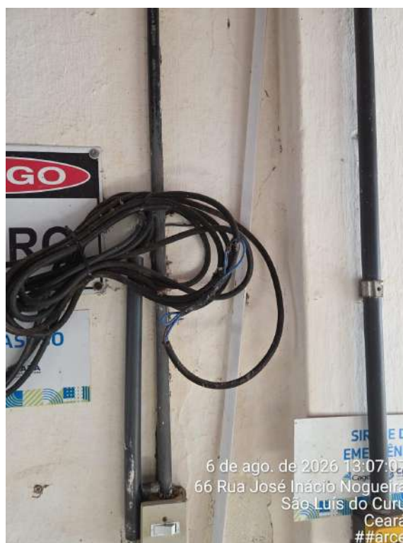
Foto 82 - Casa de cloro da ETA: fiação elétrica exposta e sem proteção adequada.
