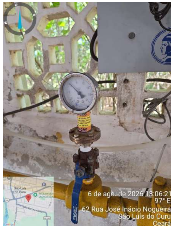
Foto 84 - Casa de cloro da ETA: manômetro e conexões metálicas com sinais de oxidação, além de fiação exposta indevidamente junto aos cobogós.
