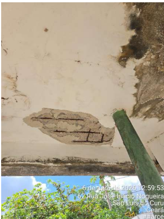
Foto 61 - REL-01: desprendimento do revestimento, exposição das armaduras e sinais de deterioração do concreto.
