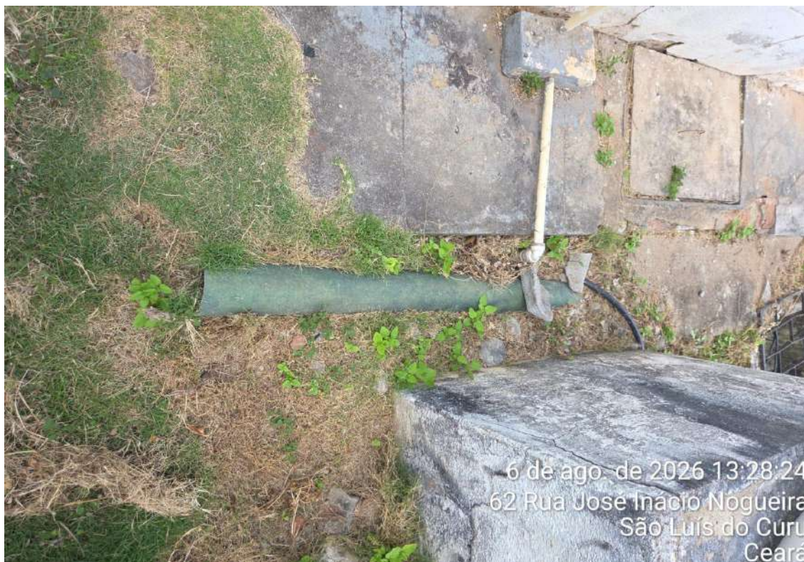
Foto 23 - Torre de nível 1 da ETA: tubulação danificada, exposta e apoiada diretamente sobre o solo, com fio também exposto no solo.
