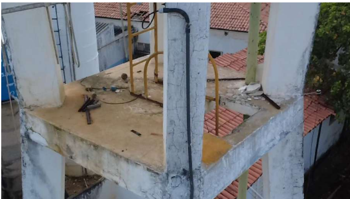
Foto 67 - REL-01: plataforma intermediária e escada fixa sem guarda-corpo, com presença de resíduos e fragmentos do revestimento do REL desprendidos, além de fissuras nos pilares.
