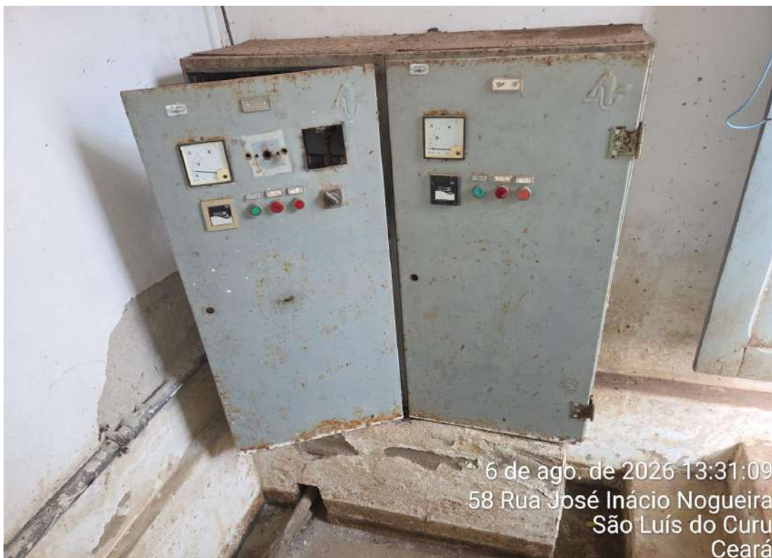
Foto 20 - Casa de bombas de lavagem dos filtros da ETA: quadro elétrico com corrosão, deterioração do gabinete e componentes de comando danificados ou ausentes.
