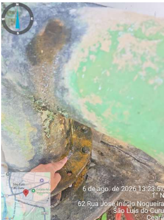
Foto 32 - Filtro de fibra 4 (F-04) da ETA: tubulação e conexão com oxidação e vazamento.
