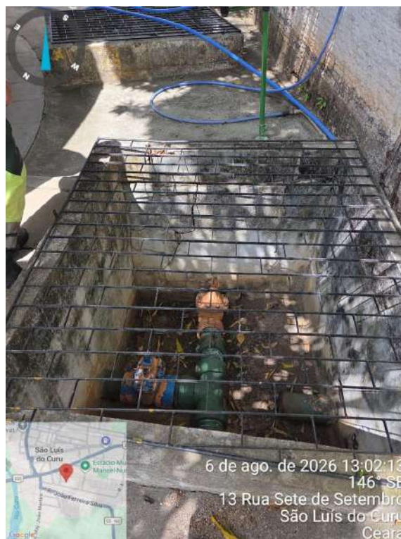
Foto 92 - Adutora da ETA: paredes da caixa de passagem com fissuras e sinais de deterioração do revestimento, além da ausência de dispositivo manual de acionamento do registro (volante/manivela).
