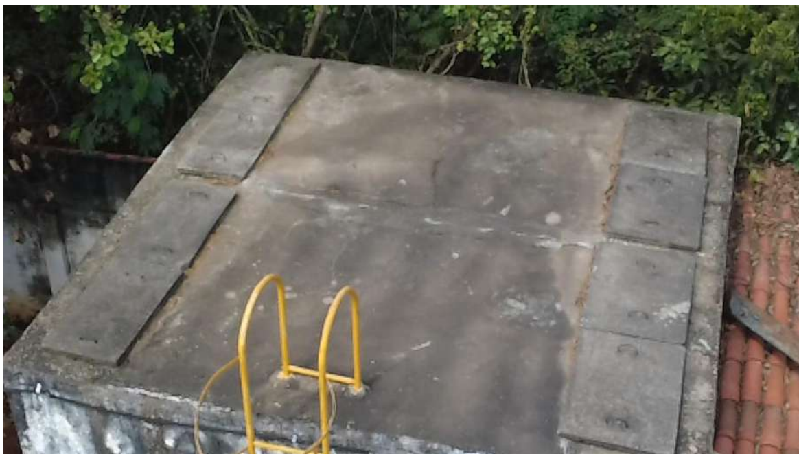
Foto 73 - Filtros de alvenaria (F-01 e F-02) da ETA: patamar superior desprovido de guarda-corpo e deterioração do revestimento.
