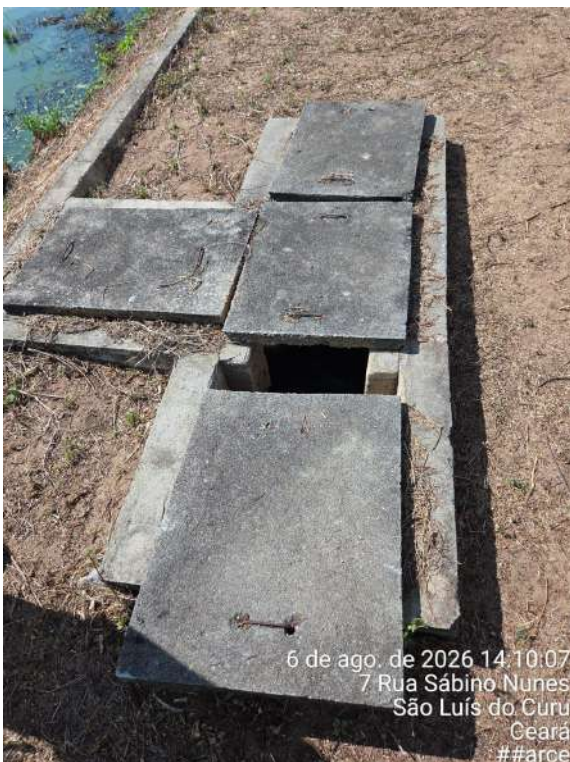
Foto 124 - Lagoa facultativa: tampas das caixas de inspeção com dimensões excessivas ou incompatíveis com as aberturas, comprometendo a vedação.
