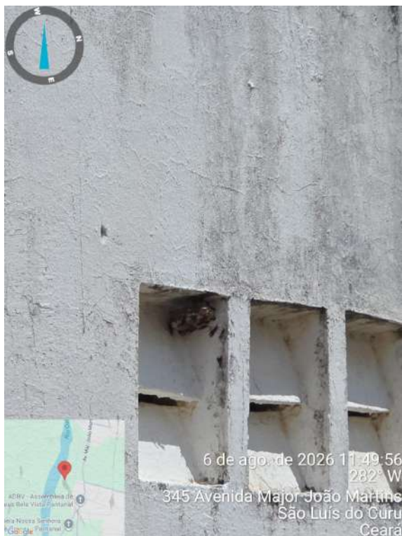
Foto 96 - EEAB-01: presença de ninho de marimbondos, impedindo o acesso ao interior em virtude da ocorrência de ataques.
