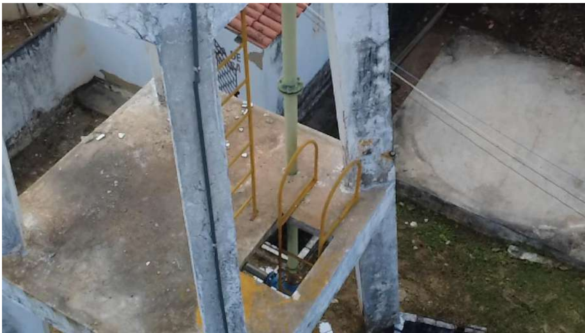
Foto 68 - REL-01: plataforma intermediária e escada fixa sem guarda-corpo, com presença fragmentos do revestimento do REL desprendidos, além de fissuras nos pilares.
