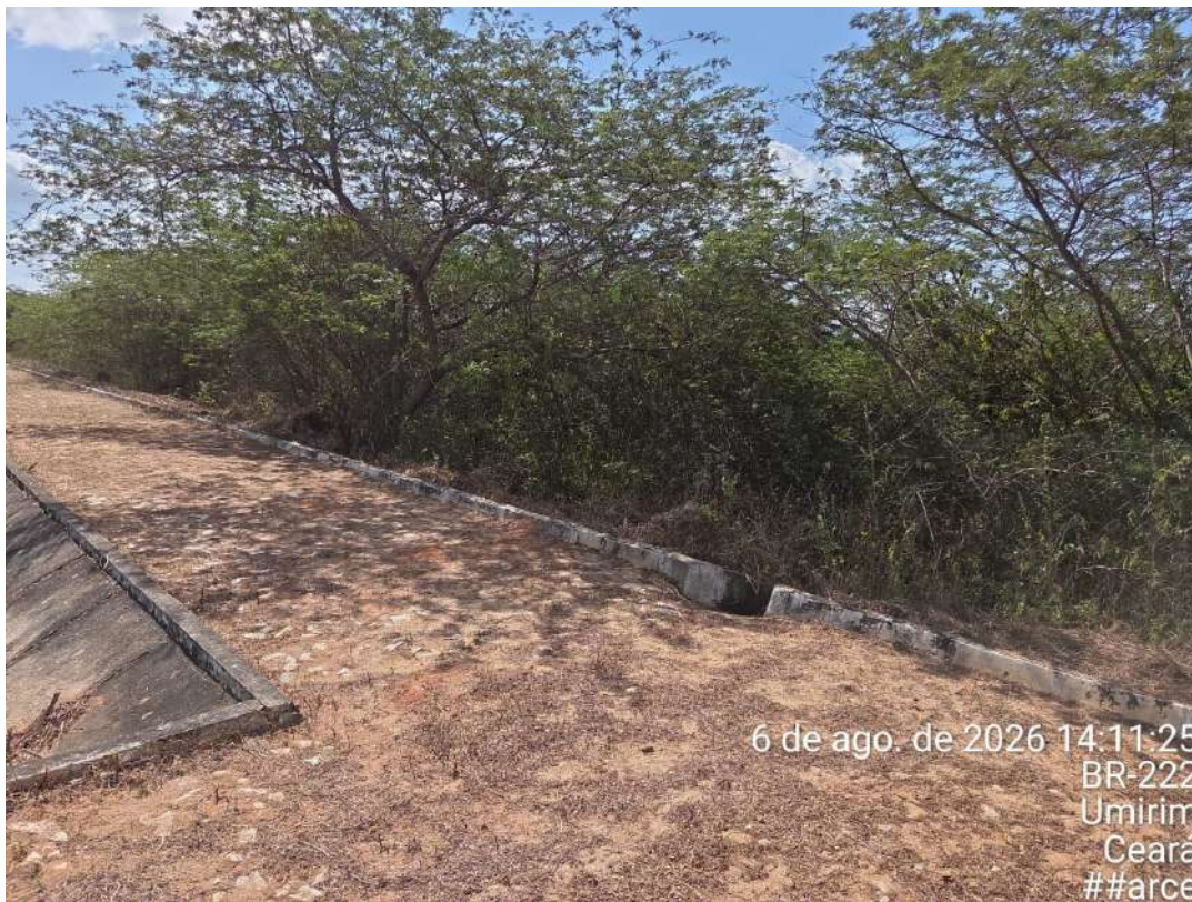
Foto 108 - Área de circulação e acesso operacional da lagoa facultativa e de maturação: ausência de cercamento no perímetro da lagoa facultativa, permitindo livre acesso à área.
