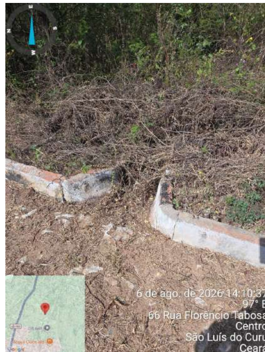
Foto 111 - Área de circulação e acesso operacional da lagoa facultativa e maturação: canaleta de drenagem da via de acesso a lagoa facultativa com fissuras e associada à presença excessiva de vegetação.
