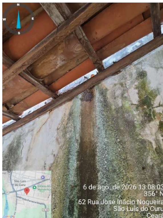
Foto 77 - Filtros de alvenaria (F-01 e F-02) da ETA: sinais de umidade e infiltração na parede.
