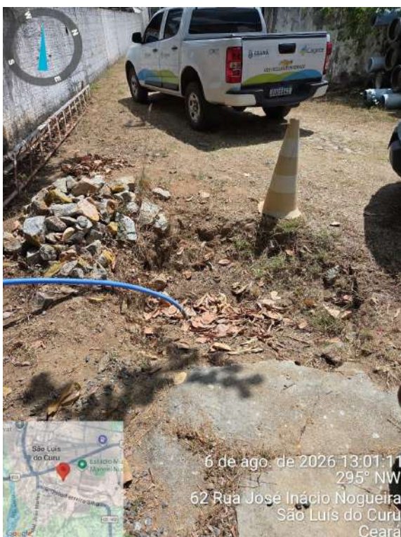
Foto 48 - Área de circulação e acesso operacional da ETA: tubulação exposta no solo, piso irregular, presença de resíduos e depressões no terreno.
