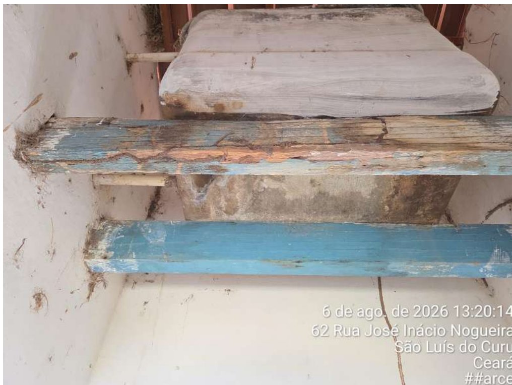
Foto 43 - EEAT-01: suporte estrutural de madeira da caixa d'água do banheiro com deterioração e com caminhos/estruturas indicativas de infestação por cupins.
