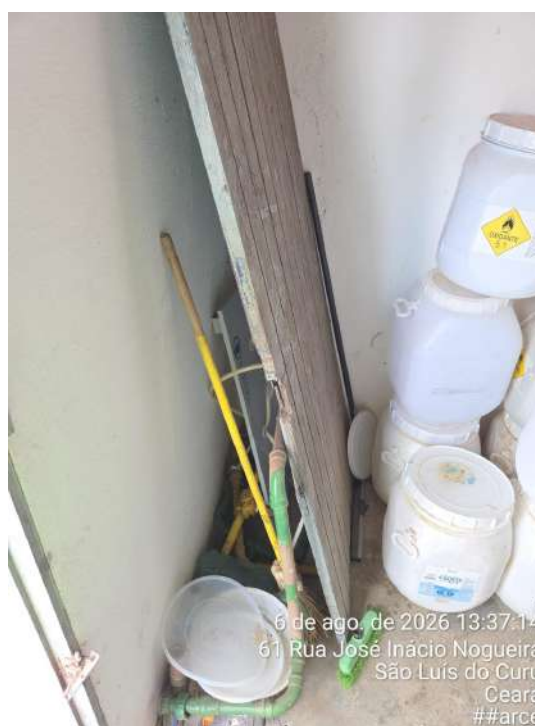
Foto 6 - Casa de química da ETA: armazenamento inadequado de recipientes de produtos químicos, sem segregação aparente e junto a materiais diversos.
