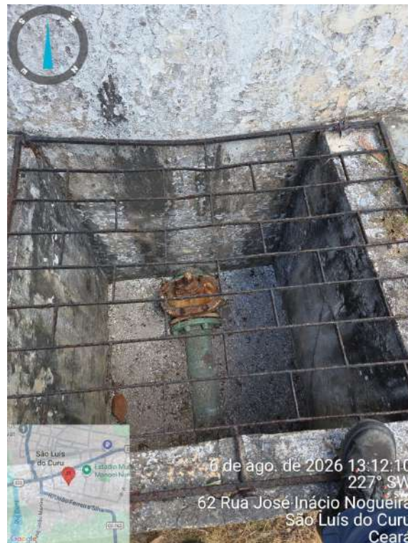
Foto 58 - RAP-01: grade de proteção da caixa de manobra com sinais de corrosão e deformação, tubulação e componentes com sinais de oxidação e sem dispositivo manual de acionamento do registro (volante/manivela).
