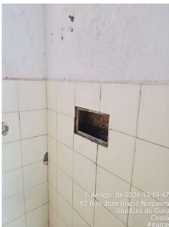
Foto 41 - EEAT-01: acionador de descarga do aparelho sanitário do banheiro ausente e revestimento cerâmico quebrado.
