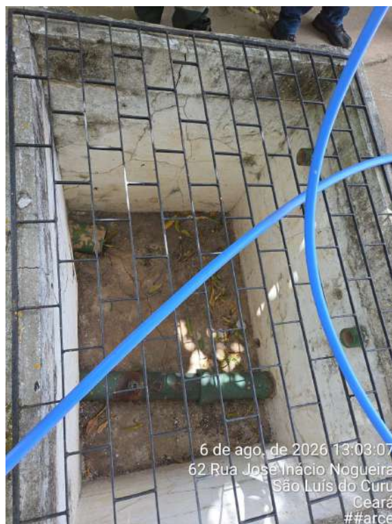
Foto 89 - Adutora da ETA: caixa de passagem sem escada de acesso, paredes com rachaduras e com sinais de deterioração do revestimento.
