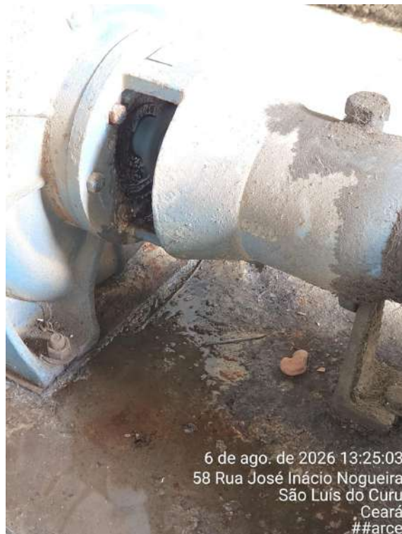
Foto 29 - EEAT-02: conjunto motobomba com acoplamento sem proteção adequada e acúmulo de água/óleo na base.
