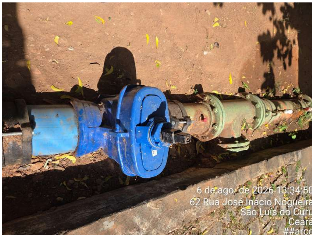
Foto 11 - Adutora dos filtros de fibra (F-03 e F-04) da ETA: registro sem dispositivo manual de acionamento (volante/manivela).
