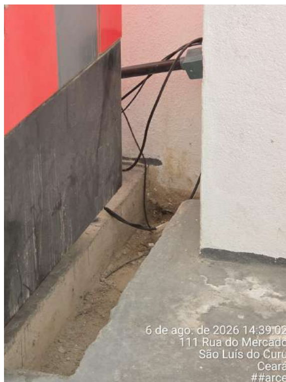
Foto 130 - EEE-01: cabos elétricos soltos e dispostos de forma inadequada, sem fixação e canaletas apropriadas.
