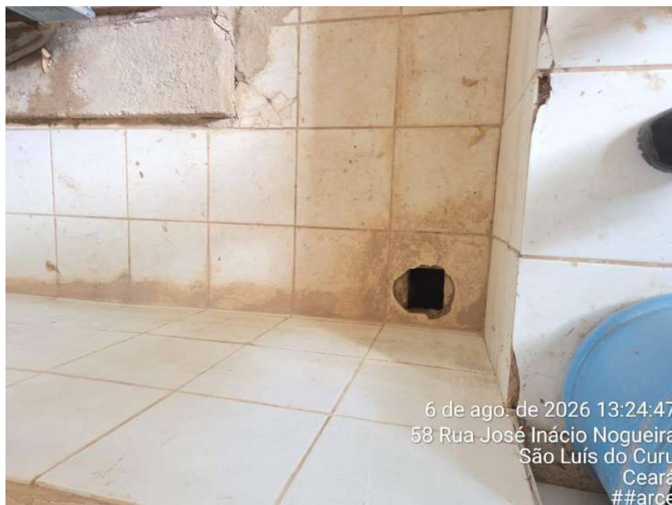
Foto 27 - EEAT-02: abertura na parede sem vedação e acabamento adequados, associada a revestimento cerâmico danificado e sinais de deterioração.
