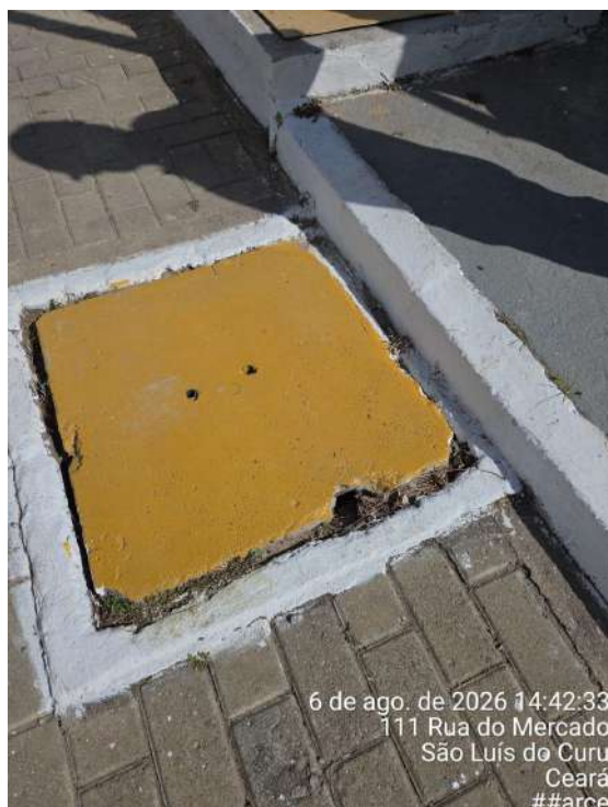
Foto 134 - EEE-01: tampa da caixa de inspeção danificada, com quebra nas bordas e vedação inadequada.
