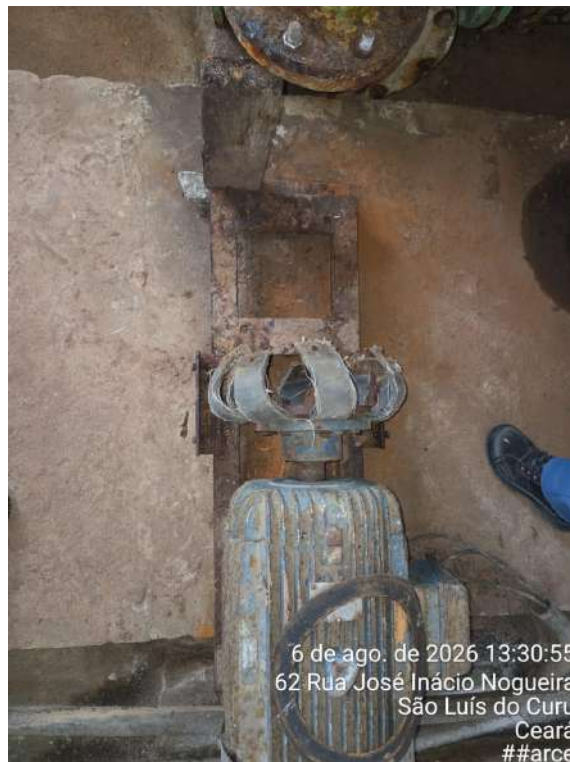
Foto 15 - Casa de bombas de lavagem dos filtros da ETA: conjunto motobomba com acoplamento danificado e sem proteção adequada, apresentando sinais de corrosão.
