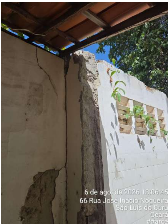
Foto 83 - Casa de cloro da ETA: parede com fissuras e perda de revestimento.
