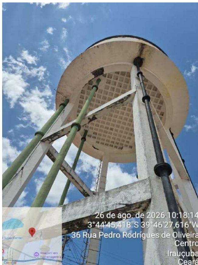
Foto 35 - REL-01: fissuras nos pilares, desprendimento do revestimento e exposição das armaduras, além de oxidação das tubulações e conexões hidráulicas.
