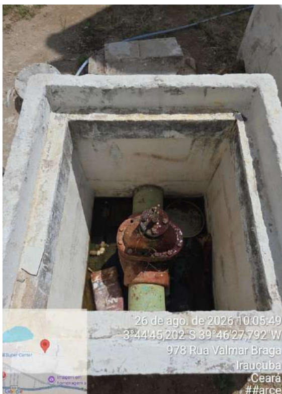
Foto 8 - REL-01: caixa de registro de manobra sem tampa ou grade de proteção.
