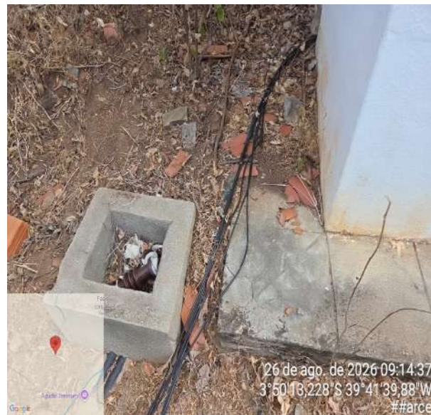
Foto 7 - Casa de Comando (Açude Jerimum): fiação exposta e desorganizada sobre o solo, associada à caixa de passagem aberta e presença de resíduos.
