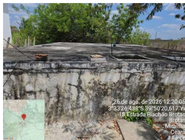
Foto 44 - RSE-02: deterioração do revestimento da parede e da laje, associado a presença de sinais de umidade e de fissuras.
