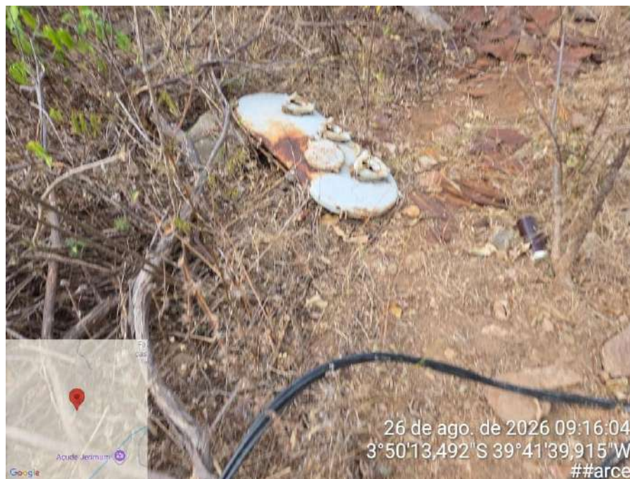
Foto 4 - Captação (Açude Jerimum): fiação associada à adutora exposta e desorganizada, disposta sobre o solo e ao longo da área de acesso operacional, além da presença de vegetação e resíduos.
