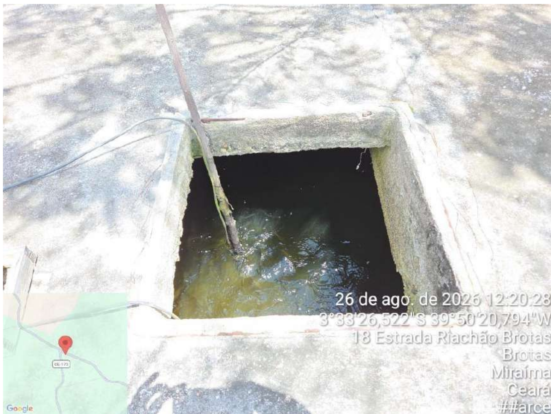
Foto 45 - RSE-02: reservatório com abertura destampada e sem proteção adequada, com comprometimento da adequada vedação.
