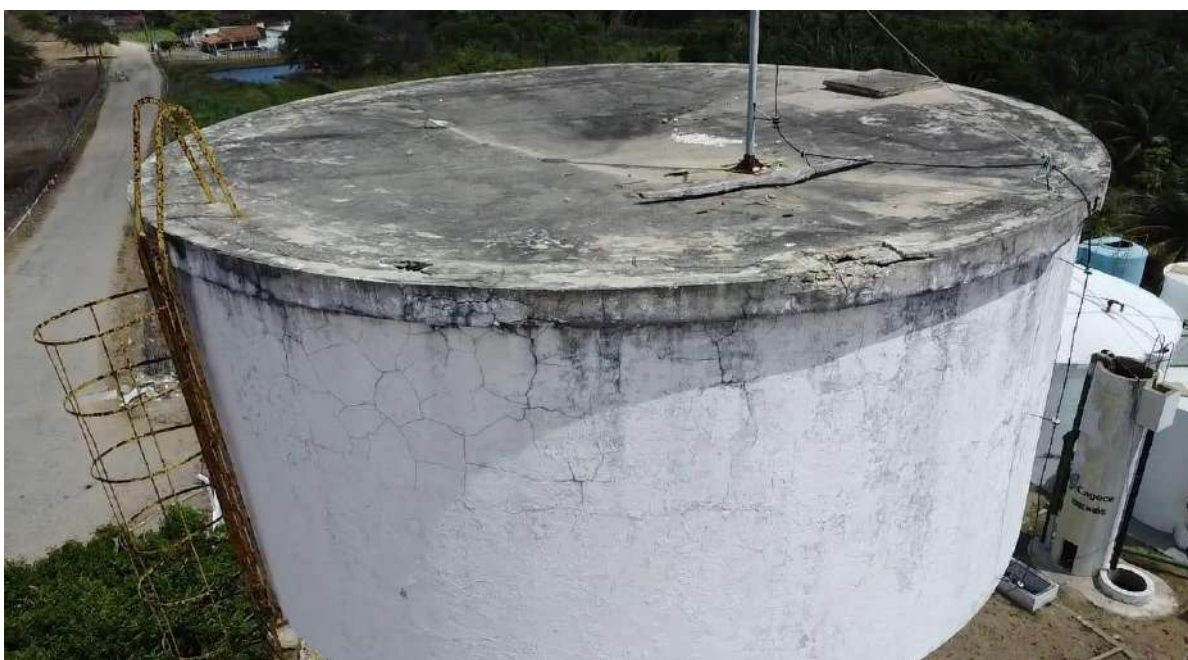
Foto 32 - REL-01: presença de fissuras e de sinais de umidade, além de deterioração no revestimento.
