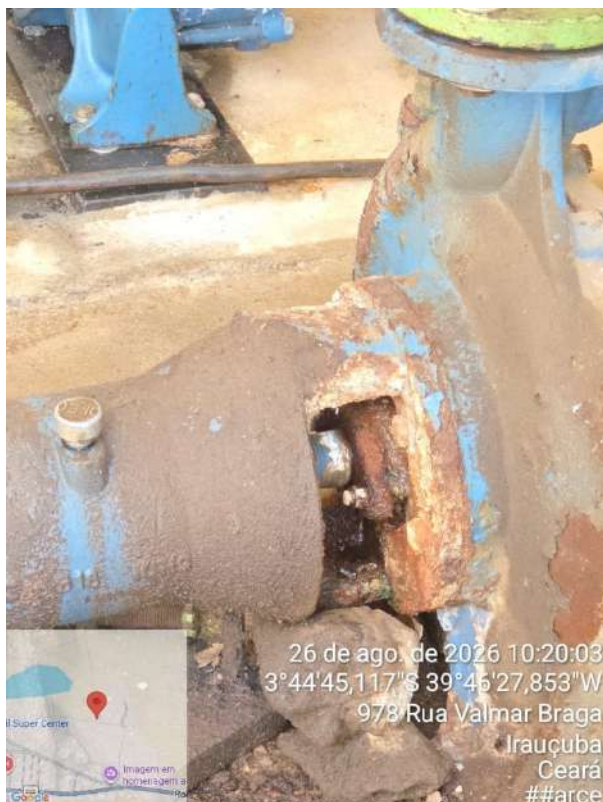
Foto 41 - EEAT-01: presença de vazamentos e sujidades.
