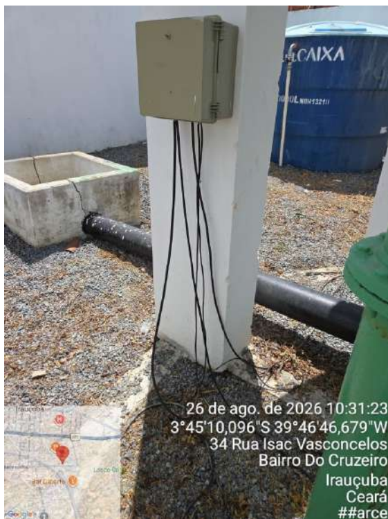
Foto 10 - REL-02: fiação elétrica exposta e desorganizada, sem proteção por eletroduto, com cabos soltos e dispostos até o nível do solo.
