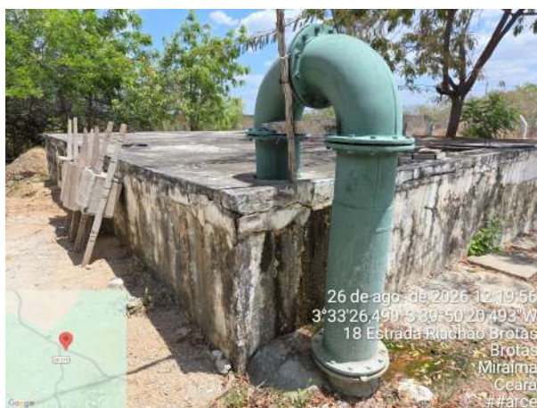
Foto 43 - RSE-02: deterioração do revestimento da parede e da laje, associado a presença de sinais de umidade e de fissuras.
