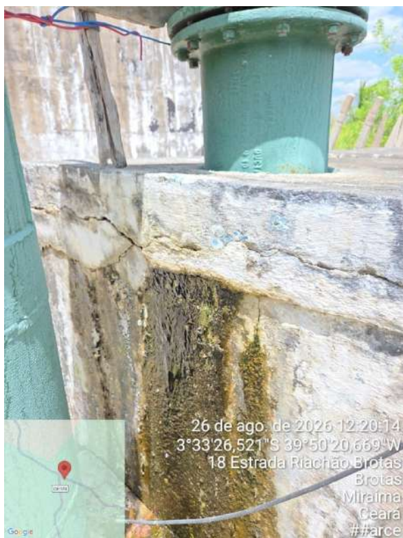
Foto 46 - RSE-02: deterioração do revestimento da parede, associada a presença de vazamentos e de fissuras.
