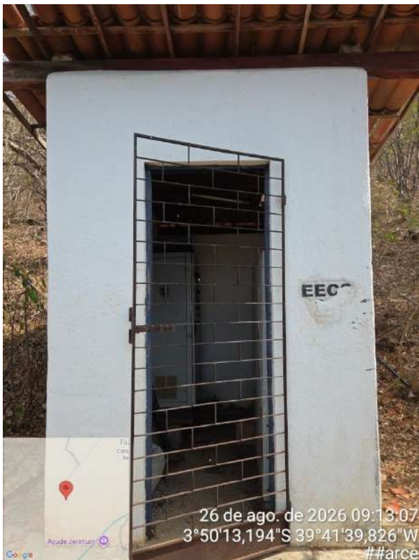
Foto 6 - Casa de comando (Açude Jerimum): identificação inadequada.
