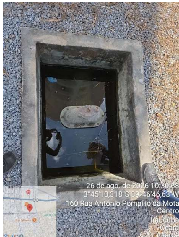
Foto 42 - REL-02: caixa do registro de manobra sem tampa ou grade de proteção, com acúmulo de água em seu interior.
