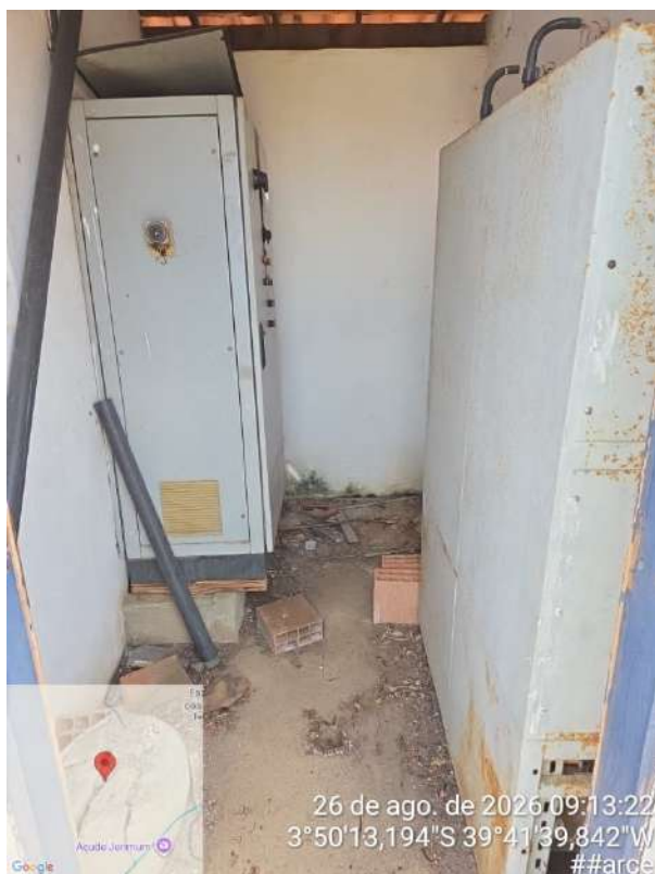
Foto 22 - Casa de comando (Açude Jerimum): quadros elétricos com sinais de corrosão, presença de resíduos, tijolos e materiais dispersos no piso.
