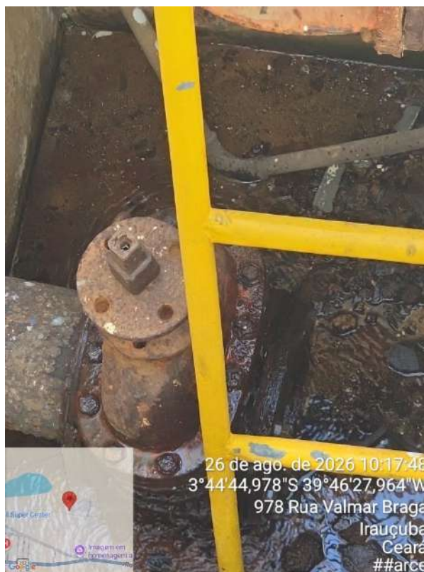
Foto 38 - RAP-01: registro de manobra com sinais de corrosão e vazamentos.
