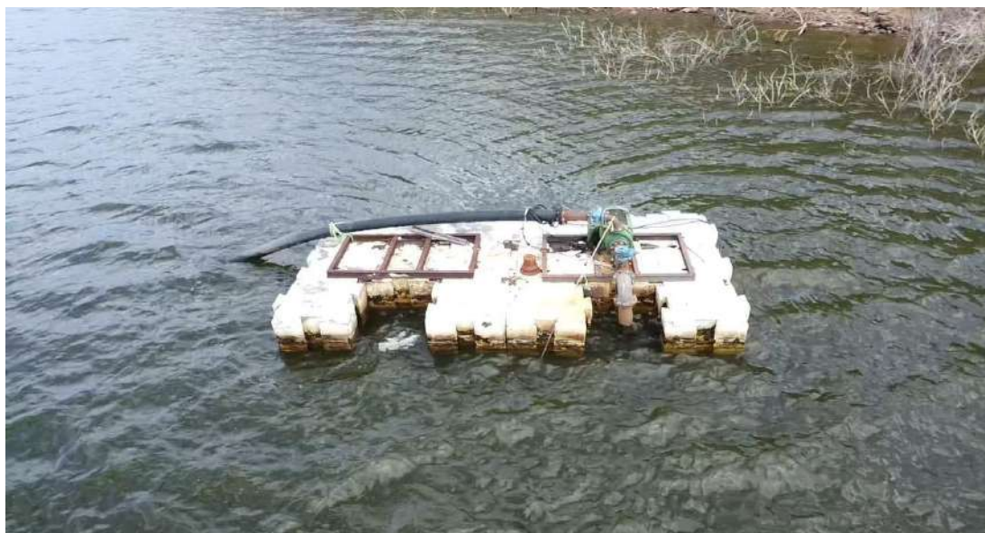
Foto 20 - Captação (Açude Jerimum): plataforma flutuante com fiação exposta e desorganizada, estrutura e piso deteriorados, presença de corrosão e ausência de proteção adequada contra quedas.
