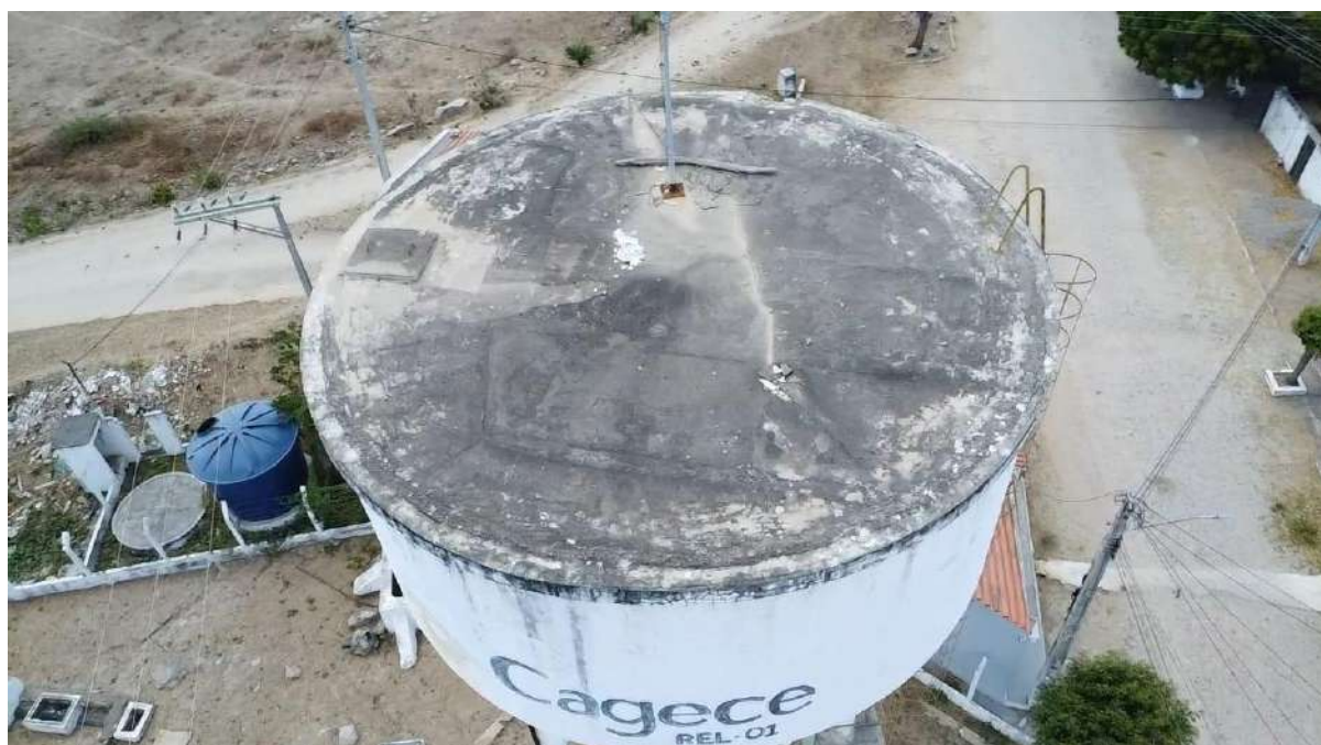
Foto 34 - REL-01: presença de fissuras na cobertura e de sinais de umidade, além de deterioração no revestimento.
