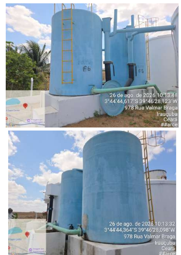
Foto 27 - F-05 e F-06: filtros desativados mantidos na área operacional, necessitando de desmobilização.
