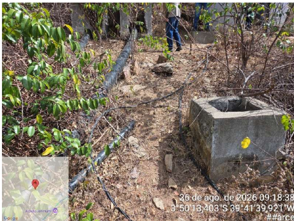
Foto 3 - Captação (Açude Jerimum): fiação associada à adutora exposta e desorganizada, disposta sobre o solo e ao longo da área de acesso operacional, além da presença de vegetação e resíduos.
