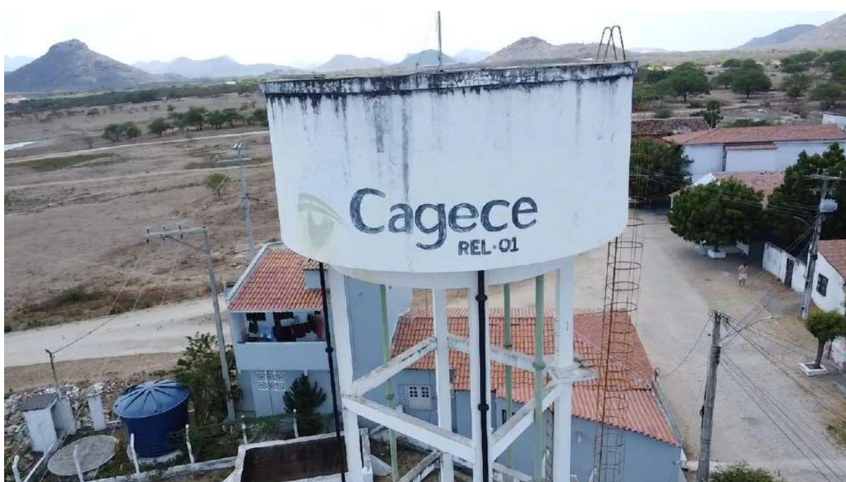
Foto 30 - REL-01: presença de fissuras e de sinais de umidade, além de deterioração no revestimento.
