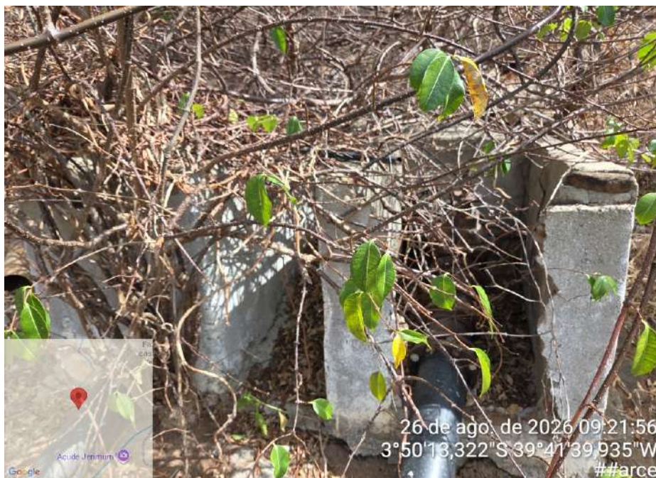
Foto 18 - Captação (Açude Jerimum): caixas de registros de manobra deterioradas e registro oxidado, além da presença de vegetação densa e de resíduos.
