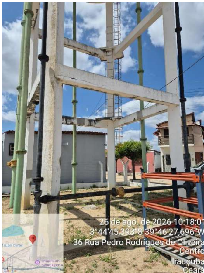
Foto 37 - REL-01: fissuras nos pilares, além de oxidação das tubulações e conexões hidráulicas.
