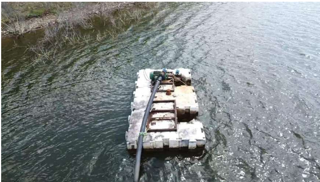
Foto 21 - Captação (Açude Jerimum): plataforma flutuante com fiação exposta e desorganizada, estrutura e piso deteriorados, presença de corrosão e ausência de proteção adequada contra quedas.
