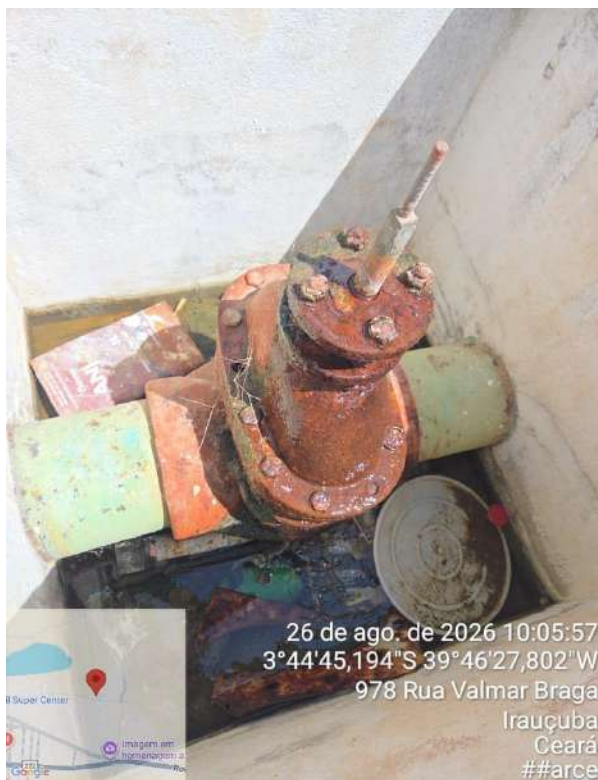
Foto 24 - REL-01: registro de manobra com sinais de corrosão e vazamento.
