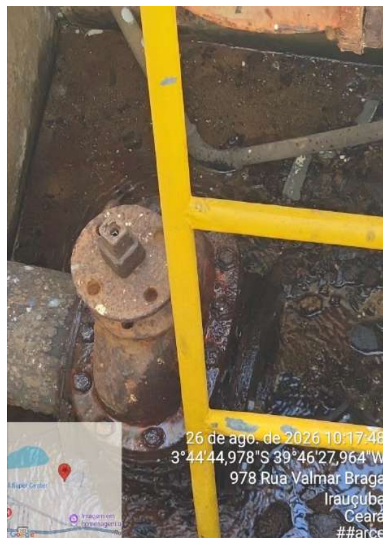
Foto 9 - RAP-01: caixa de registro de manobra sem tampa ou grade de proteção.
