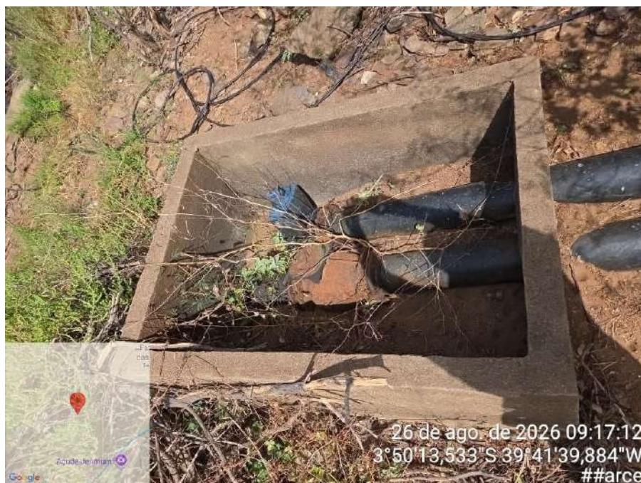
Foto 5 - Captação (Açude Jerimum): caixa de manobra aberta, sem tampa ou grade de proteção, fiação associada à adutora exposta e desorganizada, disposta sobre o solo e ao longo da área de acesso operacional, além da presença de vegetação e resíduos.
