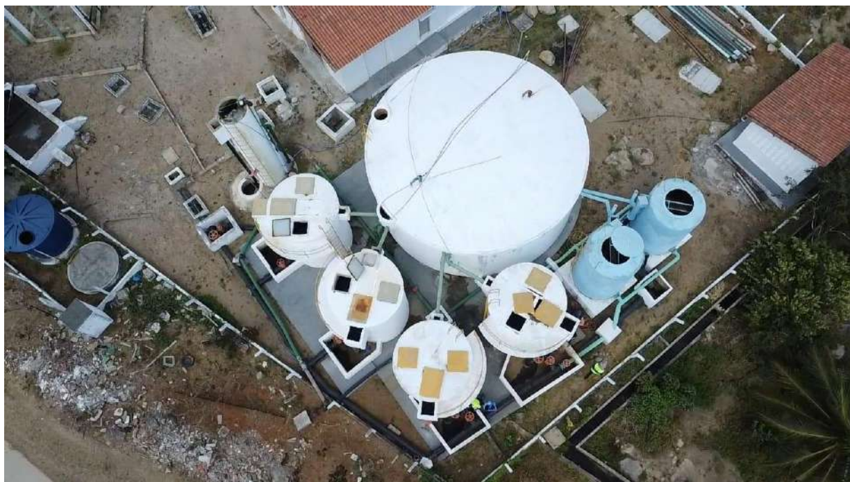
Foto 39 - RAP-01 e filtros: reservatório e filtros com aberturas destampadas e sem proteção adequada, com comprometimento da integridade e da adequada vedação das aberturas superiores.
