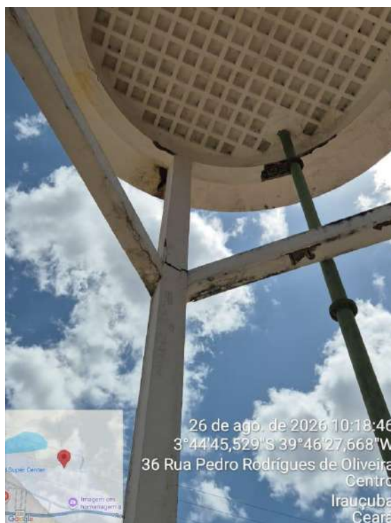
Foto 36 - REL-01: fissuras nos pilares, desprendimento do revestimento e exposição das armaduras.
