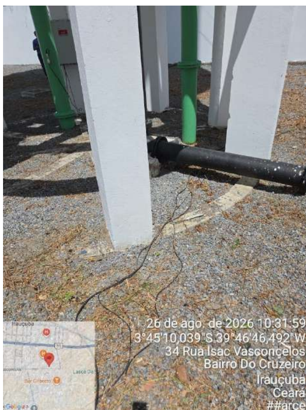
Foto 12 - REL-02: fiação elétrica exposta e desorganizada, sem proteção por eletroduto, com cabos soltos e dispostos até o nível do solo.
