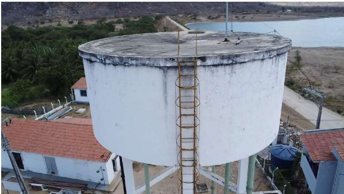
Foto 31 - REL-01: presença de fissuras e de sinais de umidade, além de deterioração no revestimento.
