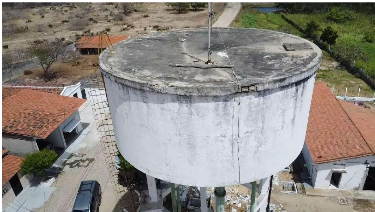
Foto 33 - REL-01: presença de fissuras e de sinais de umidade, além de desprendimento do revestimento e exposição das armaduras do concreto.
