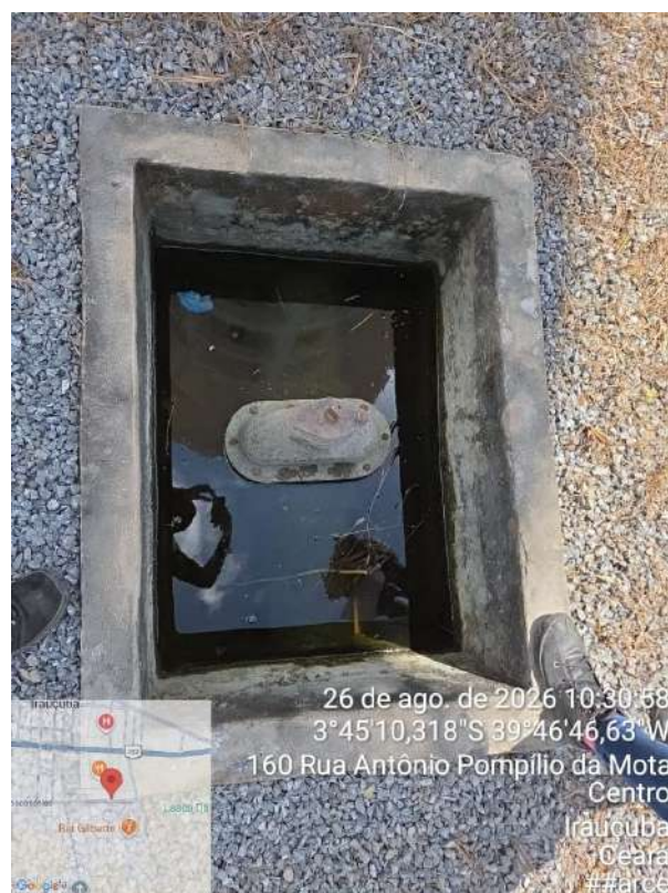
Foto 13 - REL-02: caixa de registro de manobra sem tampa ou grade de proteção.
