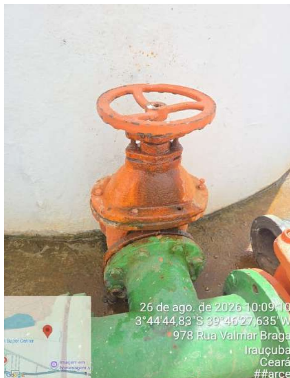
Foto 25 - F-03: registro de manobra com sinais de corrosão e vazamento.
