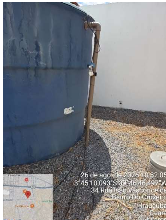
Foto 11 - REL-02: fiação elétrica exposta e desorganizada, sem proteção por eletroduto, com cabos soltos e dispostos até o nível do solo.
