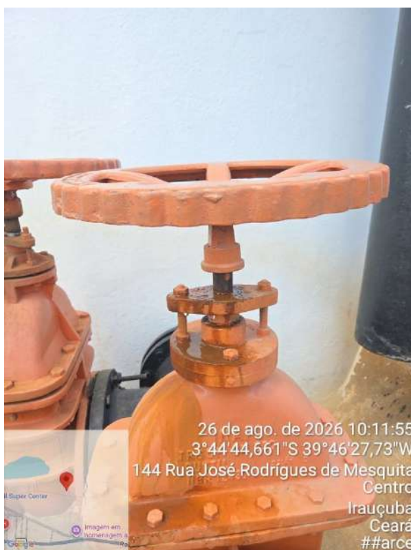
Foto 26 - F-04: presença de vazamentos.
