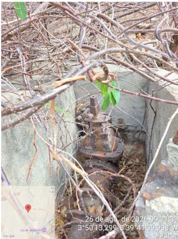
Foto 16 - Captação (Açude Jerimum): caixa de registro de manobra deteriorada e registro oxidado, além da presença de vegetação densa e de resíduos.
