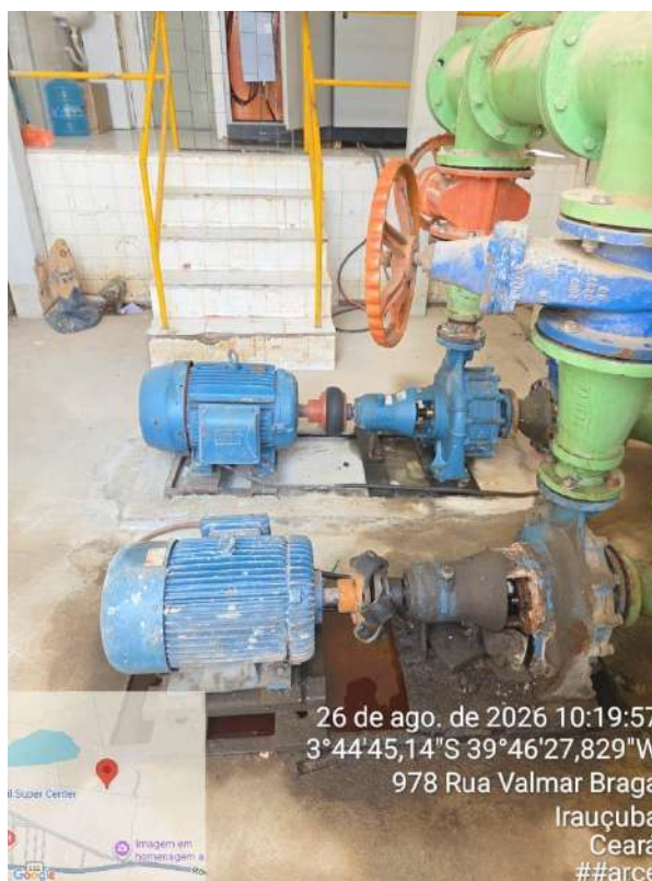
Foto 40 - EEAT-01: conjunto motobomba com corrosão, fiação exposta, ausência de proteção adequada no acoplamento e deterioração da base e do piso adjacente.
