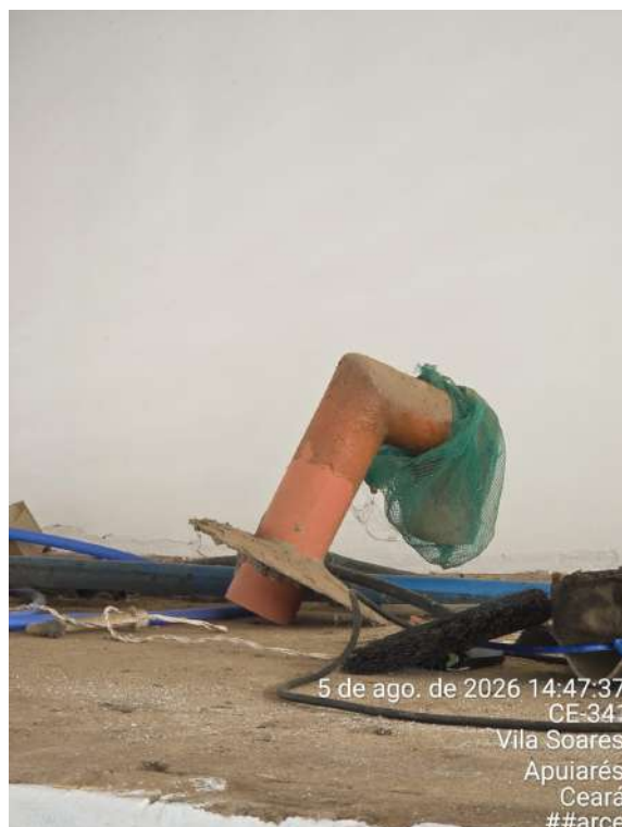
Foto 98 - RSE-02 (Sebastião de Abreu): suspiro danificado, além de materiais dispostos inadequadamente sobre o RSE.
