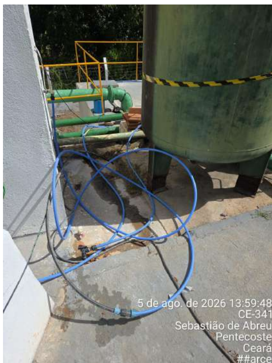
Foto 68 - ETA Sebastião de Abreu: mangueiras e cabos dispostos de forma desorganizada sobre o piso, dificultando a circulação e oferecendo risco de tropeços e quedas na área de acesso operacional.
