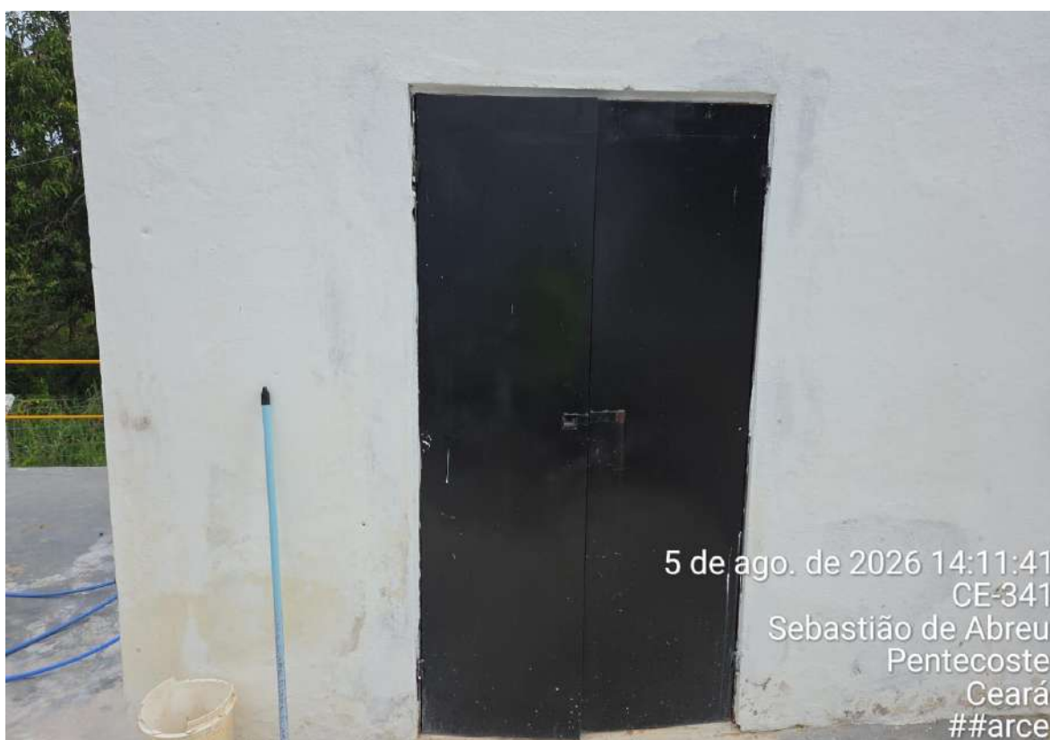
Foto 74 - ETA Sebastião de Abreu: casa de química sem identificação e com presença de manchas de umidade e deterioração do revestimento na base das paredes.
