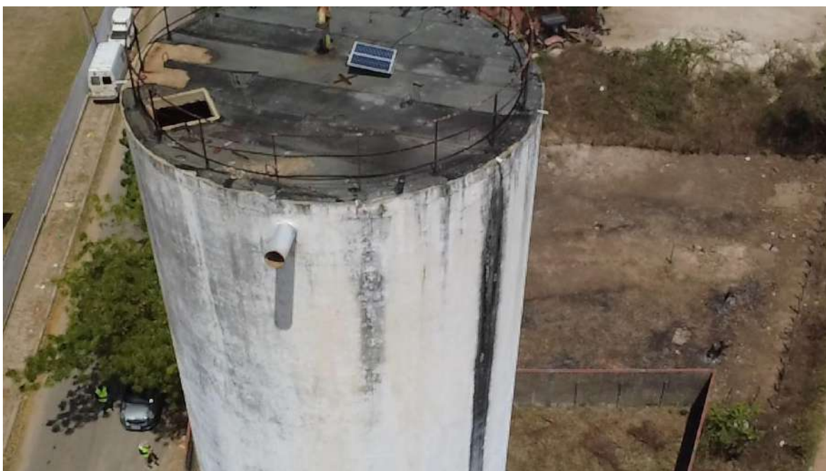
Foto 51 - REL-04 (Sede): tubulação de extravasamento sem tela ou dispositivo de proteção na extremidade, além da deterioração do revestimento e presença de manchas de umidade.
