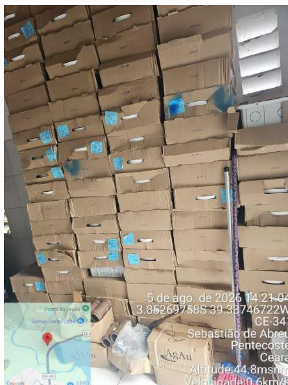
Foto 77 - ETA Sebastião de Abreu: armazenamento inadequado de materiais, com caixas empilhadas de forma excessiva e instável, oferecendo risco de queda e dificultando o acesso às instalações.
