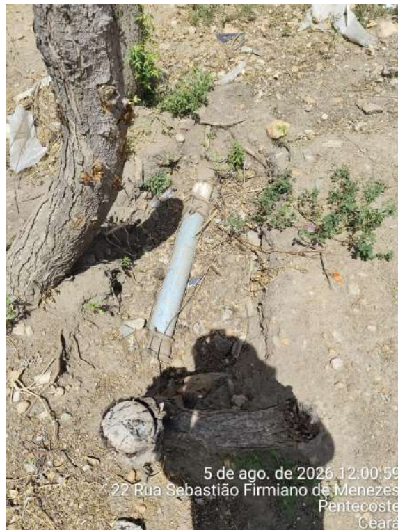
Foto 26 - REL-02 (Sede): tubulação danificada, exposta e apoiada diretamente sobre o solo.
