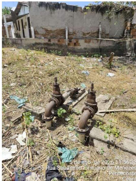
Foto 18 - REL-02 (Sede): acúmulo de resíduos, entulho e vegetação, além de tubulações e registros desativados, sem desmobilização adequada.
