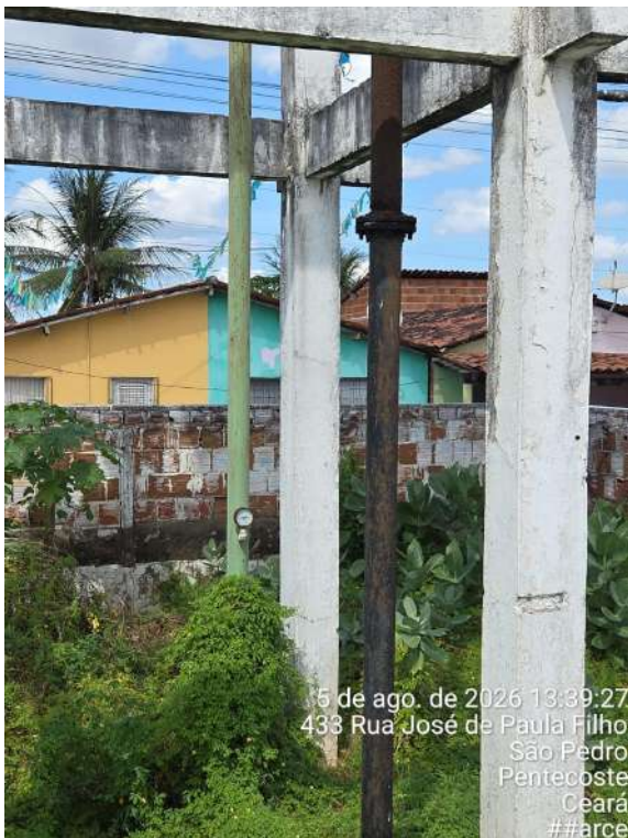
Foto 39 - REL-03 (Sede): presença de vegetação no interior da área operacional e tubulação com sinais de corrosão.
