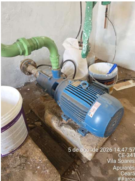
Foto 95 - RSE-02 (Sebastião de Abreu): deficiência de limpeza e organização, com materiais junto ao conjunto motobomba, cabos dispostos inadequadamente e base de apoio do conjunto motobomba deteriorada.
