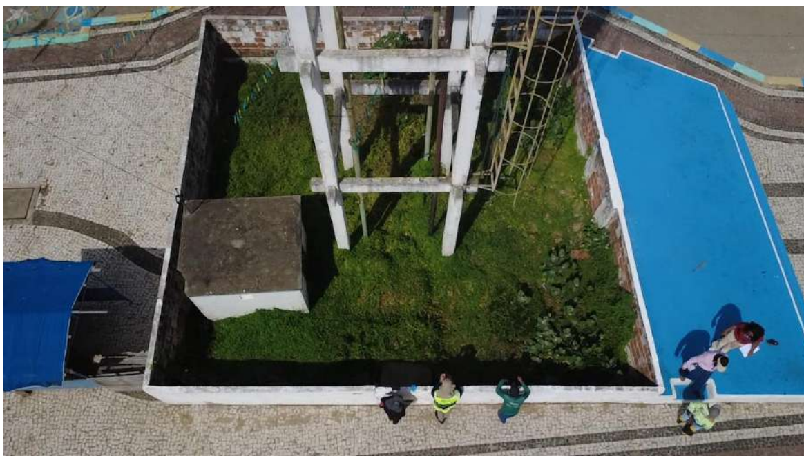
Foto 30 - REL-03 (Sede): presença de vegetação no interior da área operacional.
