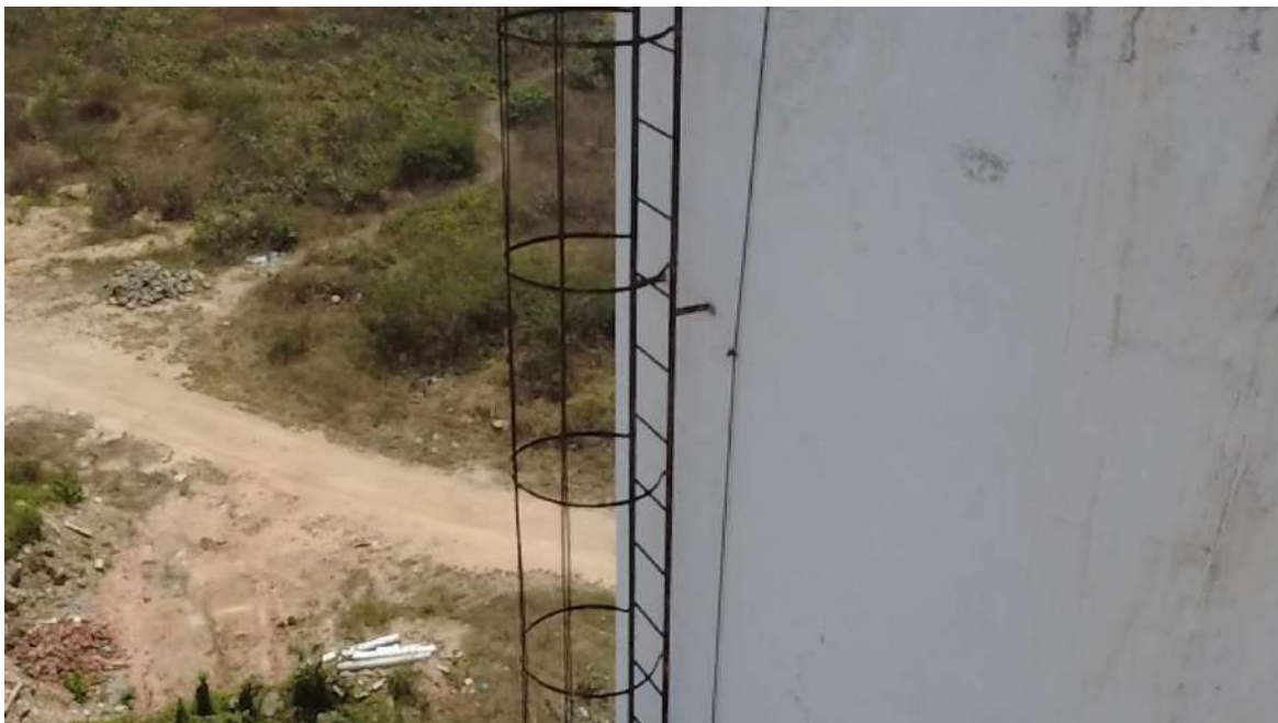
Foto 48 - REL-04 (Sede): escada com sinais de corrosão.
