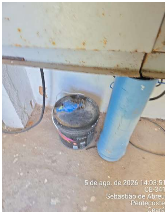
Foto 62 - ETA Sebastião de Abreu : fiação exposta, armazenamento inadequado de materiais e apoio improvisado do painel.
