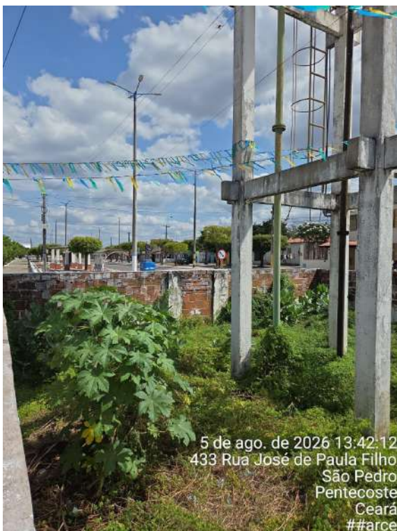
Foto 35 - REL-03 (Sede): presença de vegetação no interior da área operacional.
