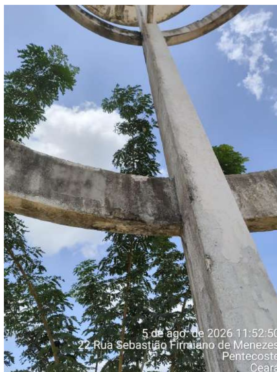
Foto 8 - REL-02 (Sede): viga com deterioração e perda do revestimento, armadura exposta e sinais de corrosão.
