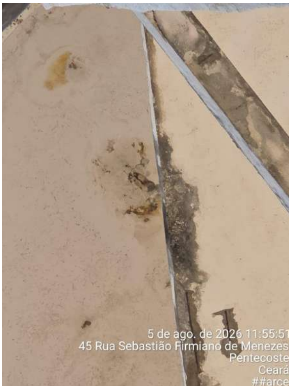
Foto 25 - REL-02 (Sede): sinais de infiltração, vazamentos, deterioração e perda do revestimento do fundo do reservatório, associado a armaduras expostas.
