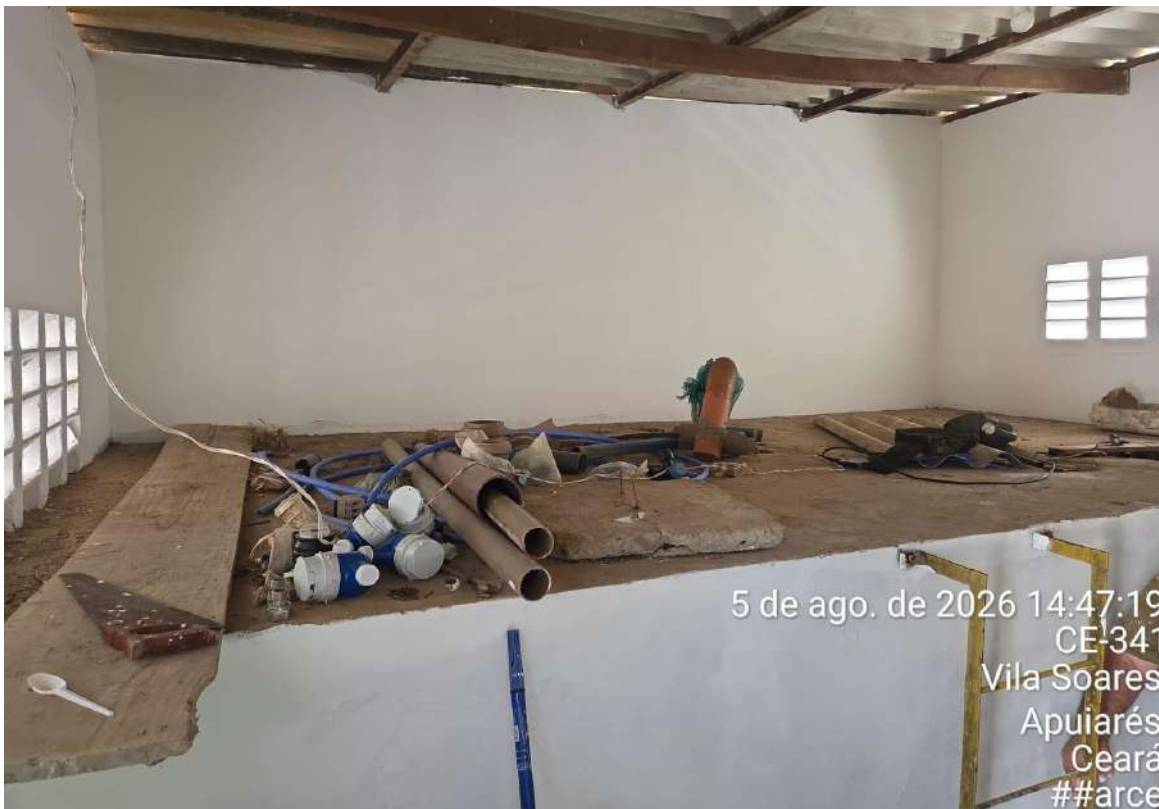
Foto 99 - RSE-02 (Sebastião de Abreu): materiais dispostos inadequadamente sobre o RSE.
