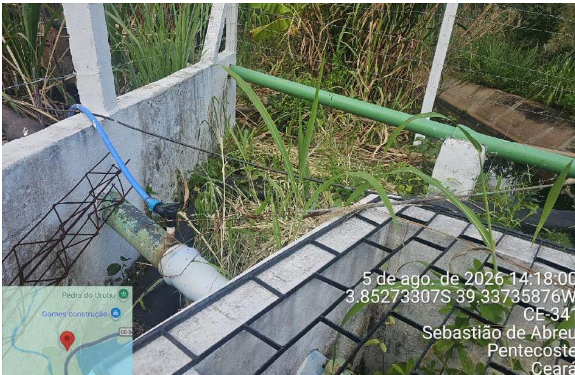
Foto 75 - ETA Sebastião de Abreu: presença de vegetação excessiva na área operacional, com estruturas metálicas expostas e sinais de corrosão, além de fiação elétrica exposta e disposta inadequadamente no solo.
