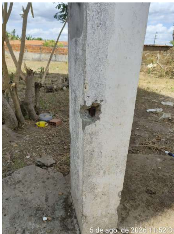
Foto 10 - REL-02 (Sede): pilar com deterioração e perda do revestimento, armadura exposta e sinais de corrosão.
