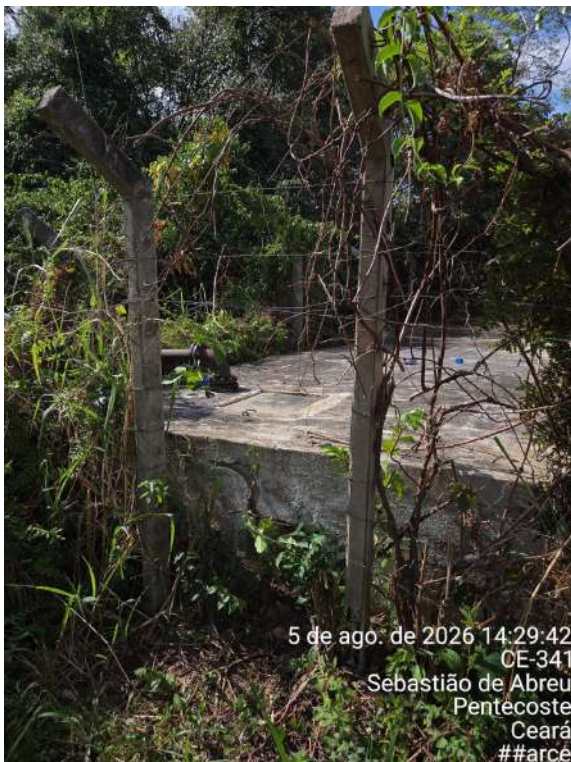
Foto 92 - RAP-01 (Sebastião de Abreu): ausência de porta de acesso operacional segura, vegetação excessiva sobre o cercamento perimetral, tubulação com sinais de oxidação e deterioração do revestimento da parede do RAP, associado a presença de fissuras.
