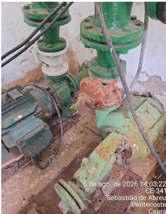
Foto 59 - ETA Sebastião de Abreu : conjunto motobomba sem proteção adequada no acoplamento, apresentando sinais de corrosão, fiação exposta e desorganizada, piso com fissuras e sujidades, além de deterioração do revestimento das paredes.
