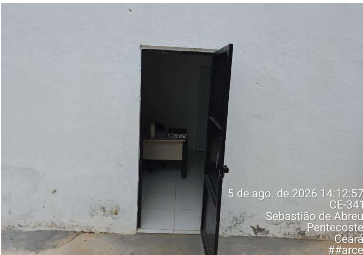
Foto 72 - ETA Sebastião de Abreu: escritório sem identificação e com presença de manchas de umidade e deterioração do revestimento na base das paredes.
