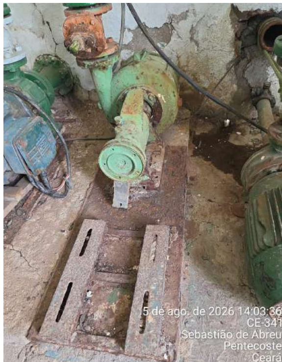
Foto 60 - ETA Sebastião de Abreu : conjunto motobomba incompleto e sem proteção adequada, apresentando sinais de corrosão, fiação exposta e desorganizada, piso com fissuras e sujidades, além de deterioração do revestimento das paredes.
