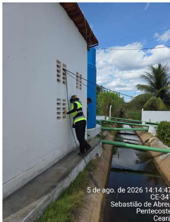
Foto 82 - ETA Sebastião de Abreu: passagem de circulação e acesso operacional estreita junto ao canal do Açude Serrota, sem guarda-corpo ou proteção contra quedas, além de fiação disposta indevidamente sobre essa passagem.
