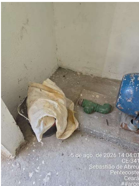
Foto 64 - ETA Sebastião de Abreu : casa de bomba com armazenamento inadequado de materiais e presença de sujeiras.
