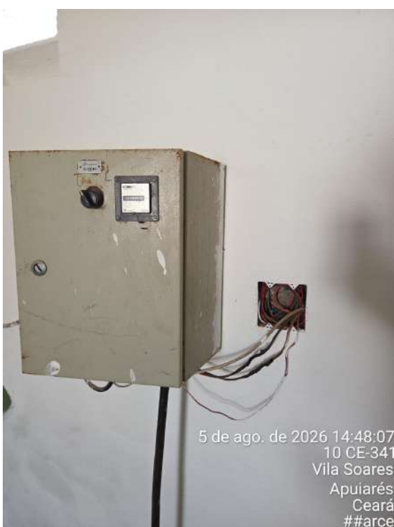
Foto 100 - RSE-02 (Sebastião de Abreu): caixa de passagem elétrica sem tampa, com fiação exposta e desorganizada, além de sinais de corrosão no quadro elétrico.
