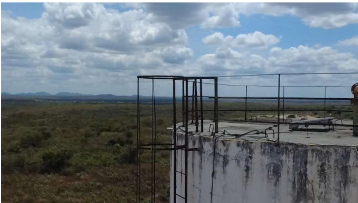
Foto 47 - REL-04 ( Sede ): guarda-corpo com sinais de corrosão.
