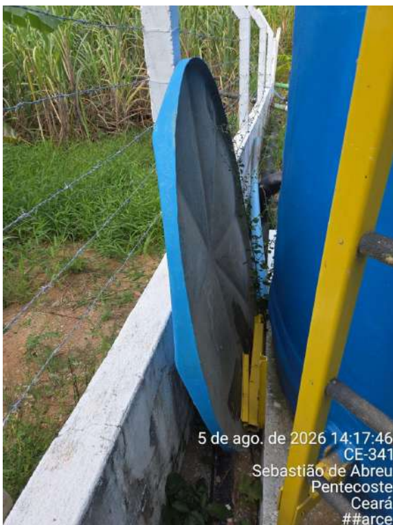
Foto 70 - ETA Sebastião de Abreu: tampa do filtro armazenada inadequadamente, com presença de vegetação e elementos metálicos soltos.
