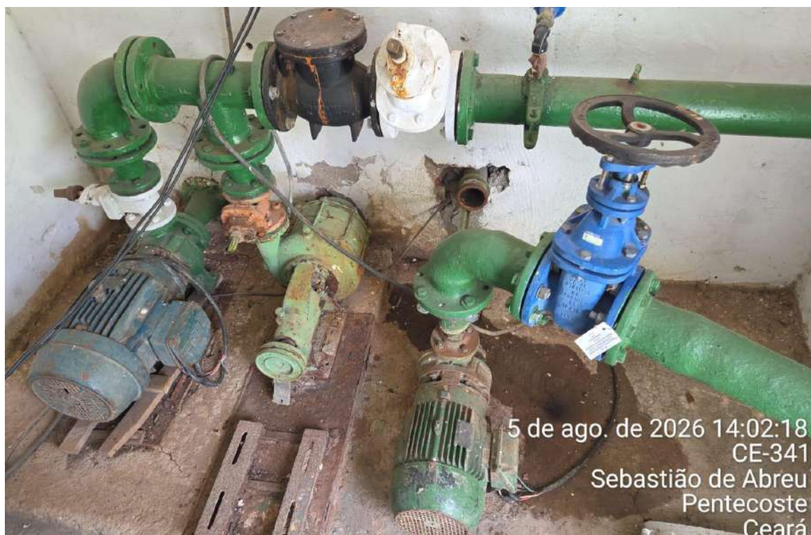
Foto 58 - ETA Sebastião de Abreu: conjunto motobomba sem proteção adequada no acoplamento, apresentando sinais de corrosão, fiação exposta e desorganizada, piso com fissuras, sujidades e água oriunda de vazamento, além de deterioração do revestimento das paredes.
