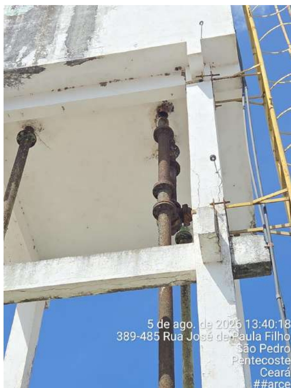
Foto 38 - REL-03 (Sede): tubulação com sinais de corrosão, além de pilar e viga com deterioração e presença de fissuras.
