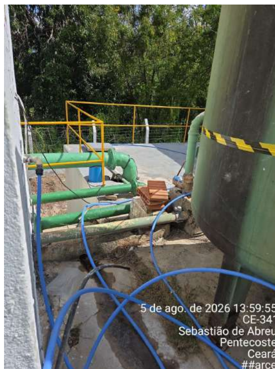
Foto 69 - ETA Sebastião de Abreu: mangueiras e materiais dispostos de forma desorganizada sobre o piso, dificultando a circulação e oferecendo risco de tropeços e quedas na área de acesso operacional.
