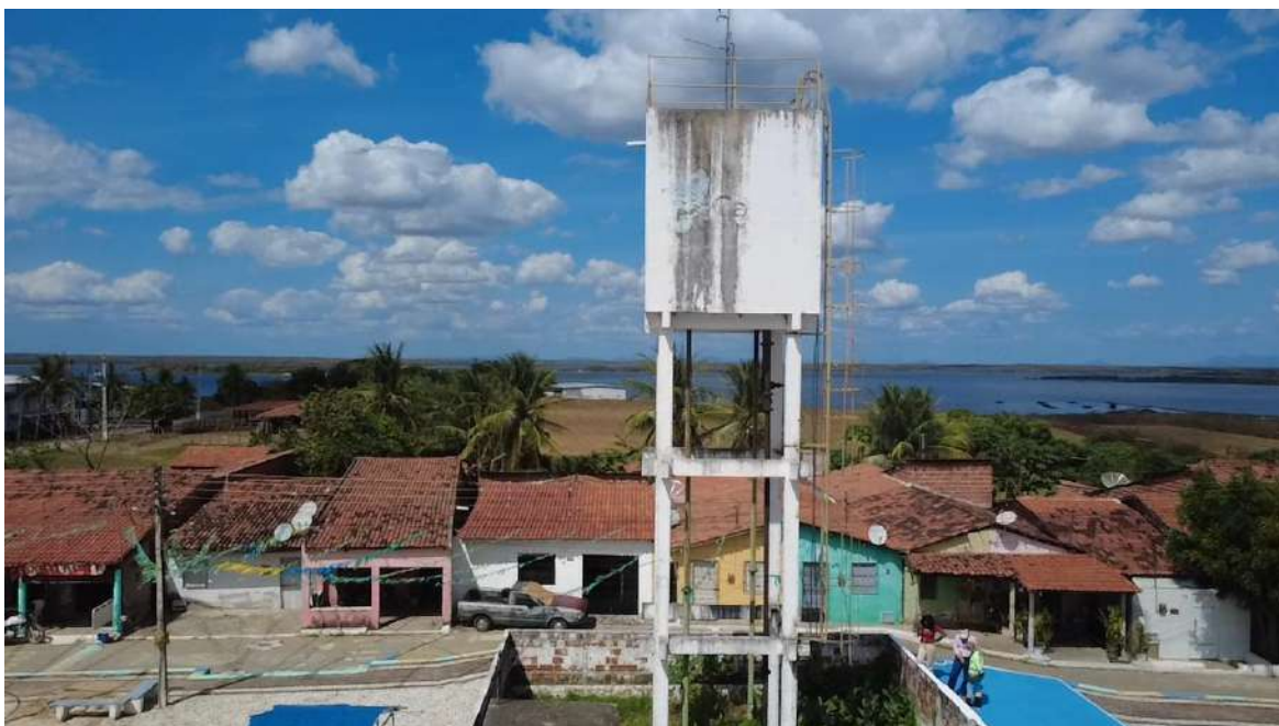
Foto 28 - REL-03 (Sede): desativado, sem desmobilização adequada, estrutura em deterioração e ausência de identificação.
