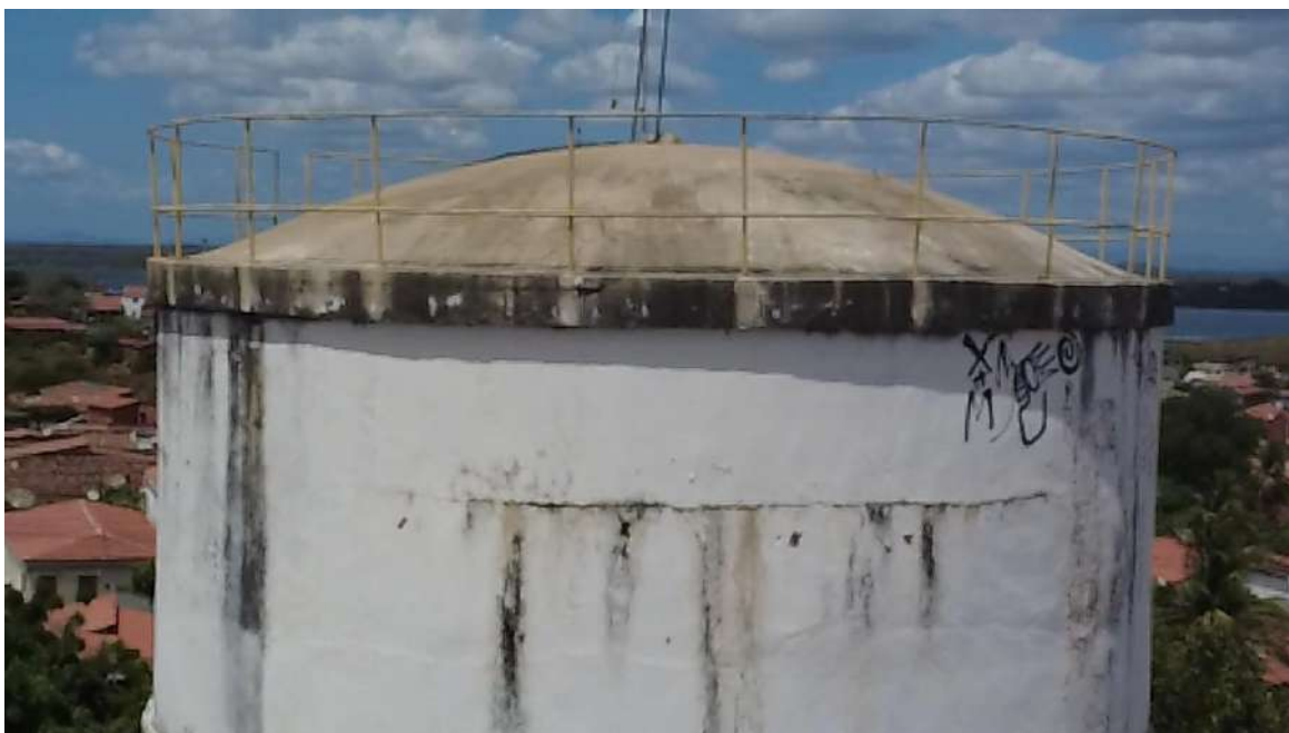
Foto 3 - REL-02 (Sede): indícios de infiltração e deterioração do revestimento da parede, associado a presença de fissuras.
