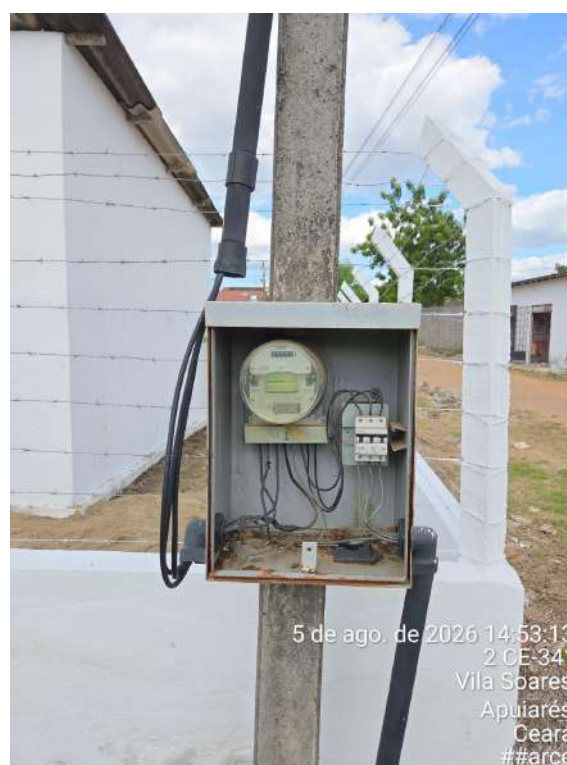
Foto 101 - RSE-02 (Sebastião de Abreu): caixa de medição elétrica sem fechamento adequado, com componentes e fiação expostos, além de sinais de corrosão na estrutura metálica.
