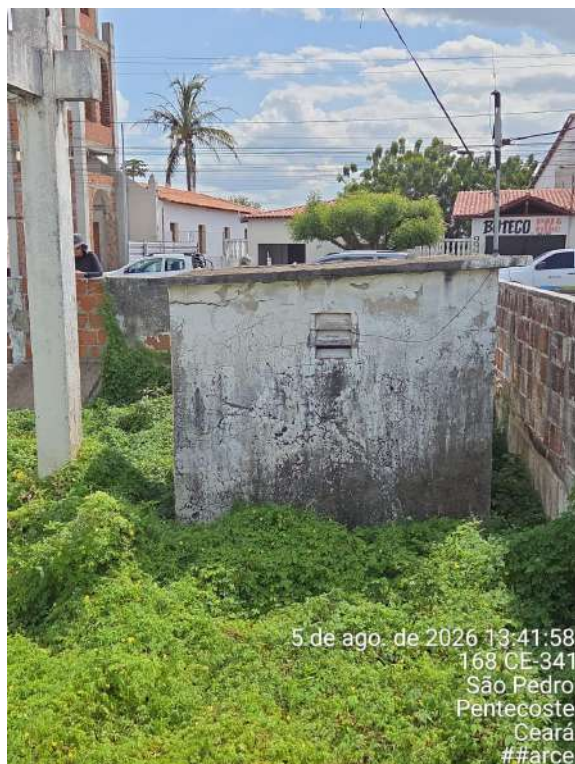
Foto 36 - REL-03 (Sede): presença de vegetação no interior da área operacional e deterioração da casa de comando, com fissuras em sua estrutura.
