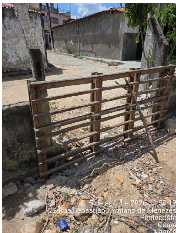
Foto 24 - REL-02(Sede): acesso à área operacional com fechamento improvisado em estrutura de madeira, sem portão adequado, além de presença de resíduos e entulho no entorno.
