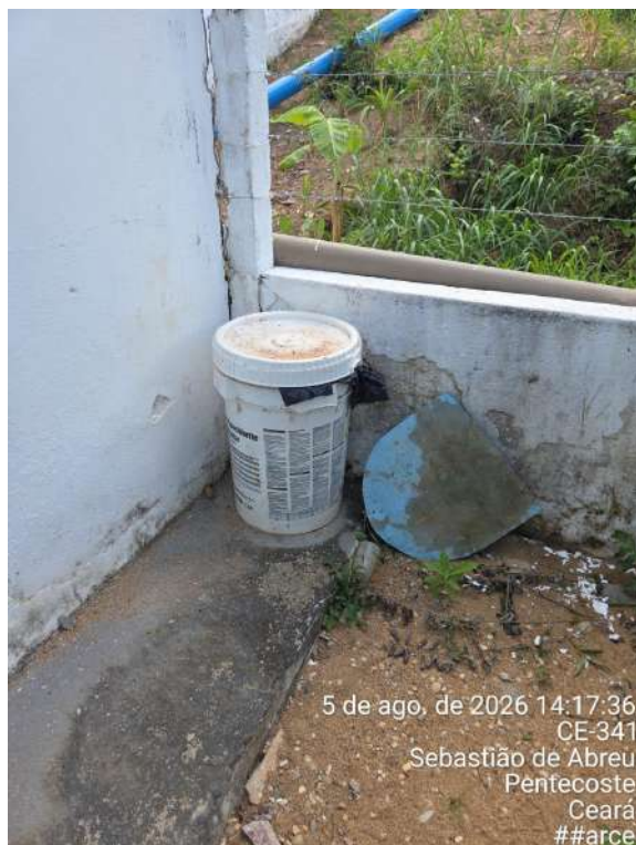
Foto 71 - ETA Sebastião de Abreu: armazenamento inadequado de materiais na área de circulação e acesso operacional, com presença de resíduos e vegetação.
