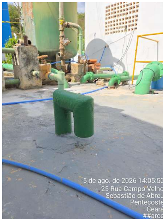
Foto 55 - ETA Sebastião de Abreu: suspiro do reservatório semienterrado (RSE-01) sem tela de proteção.
