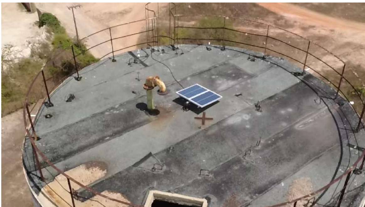
Foto 50 - REL-04 (Sede): suspiro oxidado e sem tela de proteção, guarda-corpo com sinais de corrosão, deterioração do revestimento e tampa de acesso ao reservatório aberta, comprometendo a vedação.
