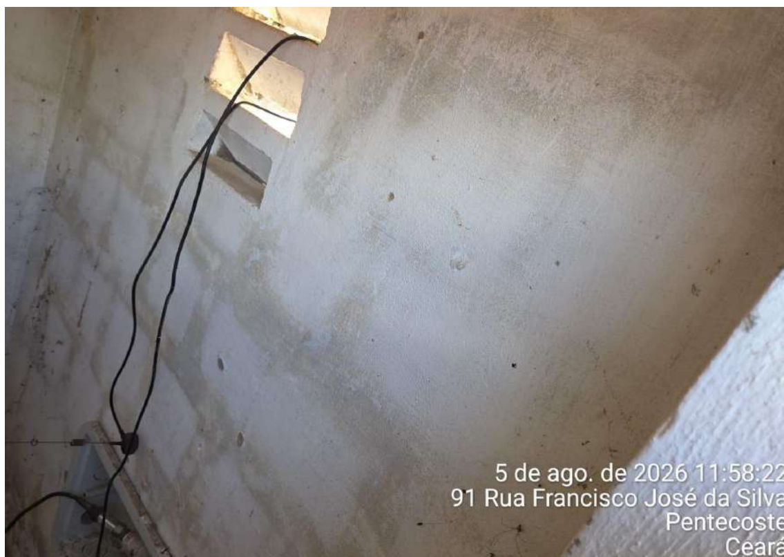
Foto 27 - REL-02 (Sede): fiação da casa de comando exposta indevidamente junto aos cobogós, desorganizada e proteção inadequada.
