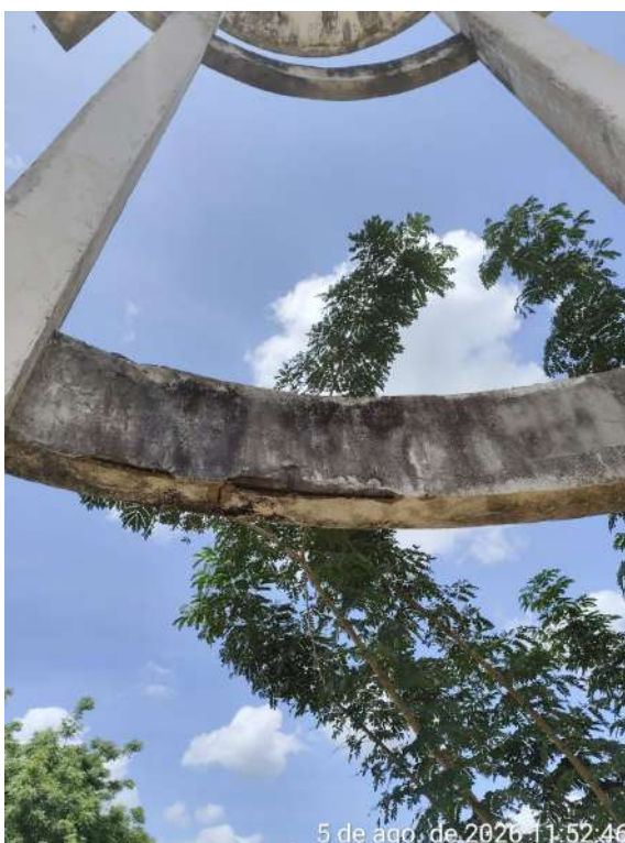
Foto 7 - REL-02 (Sede): viga com deterioração e perda do revestimento, com armadura exposta e sinais de corrosão.
