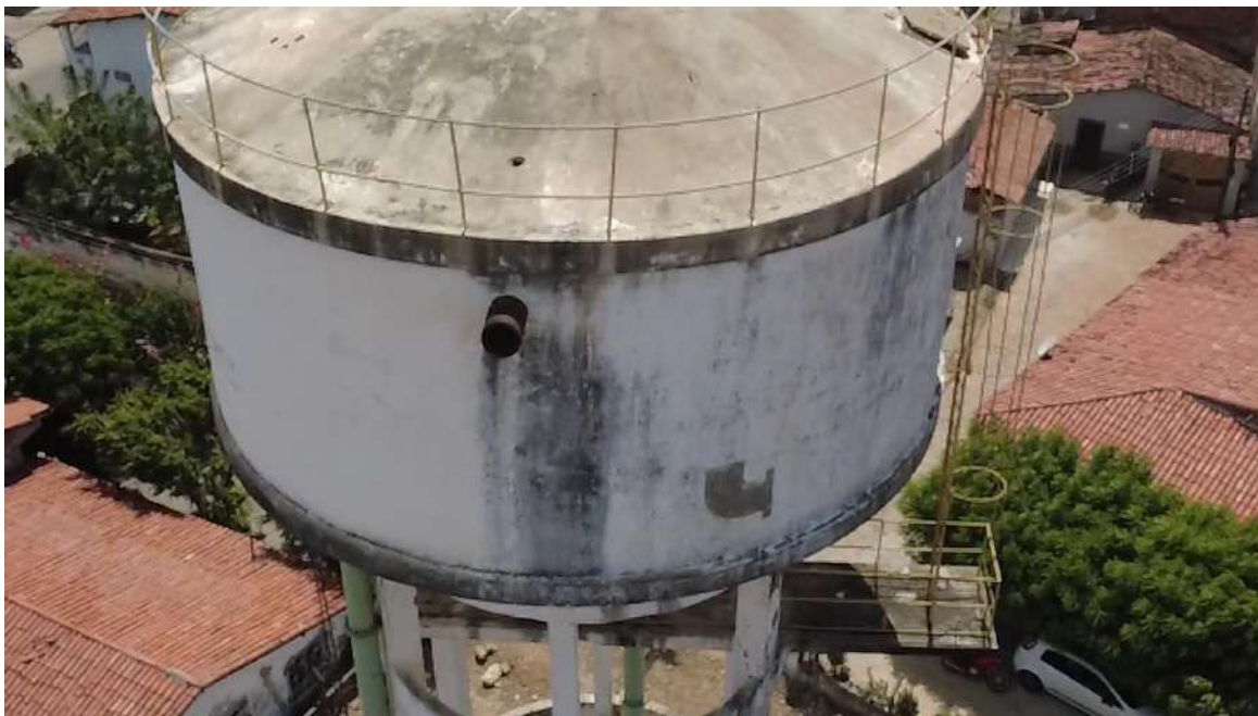
Foto 1 - REL-02 (Sede): tubulação de extravasamento sem tela ou dispositivo de proteção na extremidade, presença de manchas de umidade e deterioração do revestimento.
