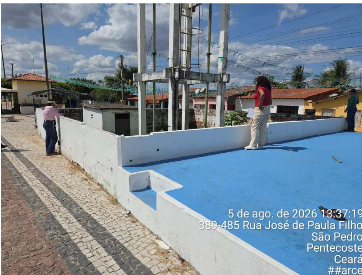
Foto 29 - REL-03 (Sede): sem fechamento adequado, com muro baixo, ausência de portão, inexistência de dispositivo seguro de acesso ao interior da unidade.
