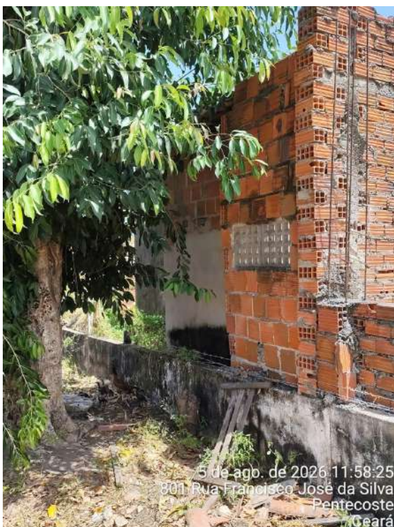
Foto 15 - REL-02 (Sede): acúmulo de resíduos sólidos, vegetação, entulho e cercamento incompleto, com mourões danificados e quantidade insuficiente de arames.
