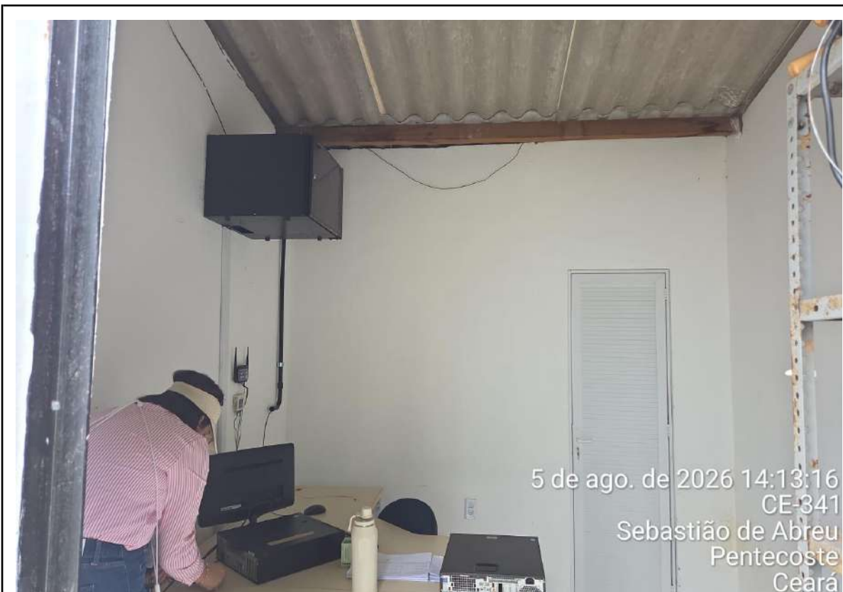
Foto 73 - ETA Sebastião de Abreu: escritório sem climatização adequada, com ventilação insuficiente e condições desfavoráveis de conforto térmico.
