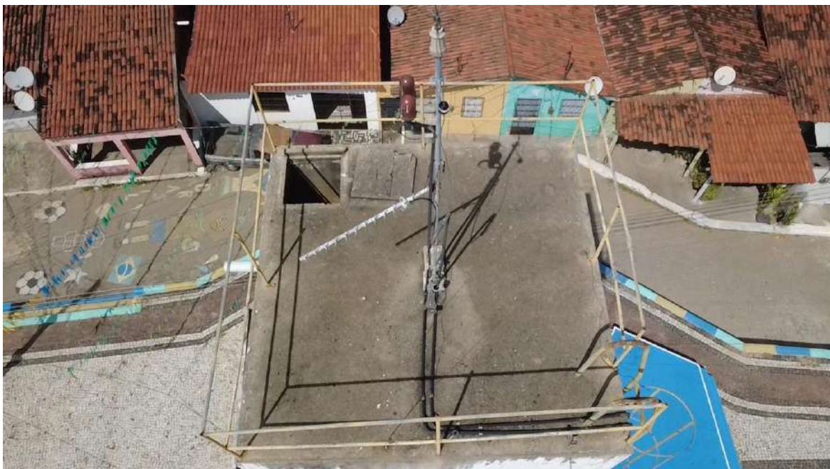
Foto 41 - REL-03 (Sede): guarda-corpo com sinais de corrosão e deformação; tampa de acesso ao reservatório aberta, comprometendo a vedação.
