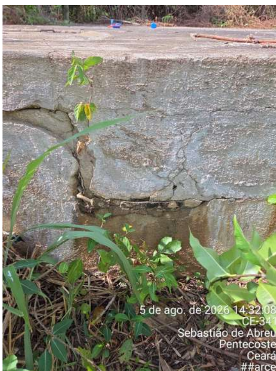
Foto 90 - RAP-01 (Sebastião de Abreu): estrutura de concreto deteriorada, com fissuras, desprendimento do revestimento, sinais de umidade/infiltração e presença de vegetação junto à base.
