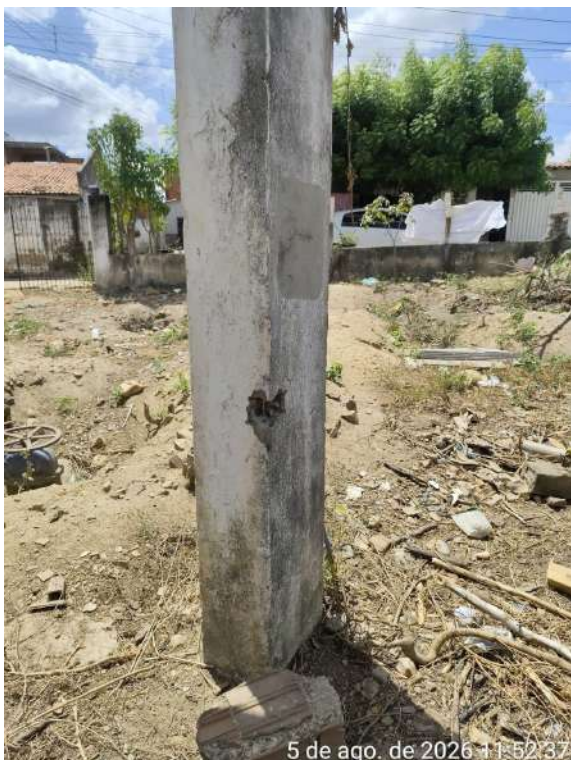
Foto 11 - REL-02 (Sede): pilar com deterioração e perda do revestimento, armadura exposta e sinais de corrosão. Terreno irregular, com acúmulo de resíduos sólidos, vegetação, entulho e materiais diversos.
