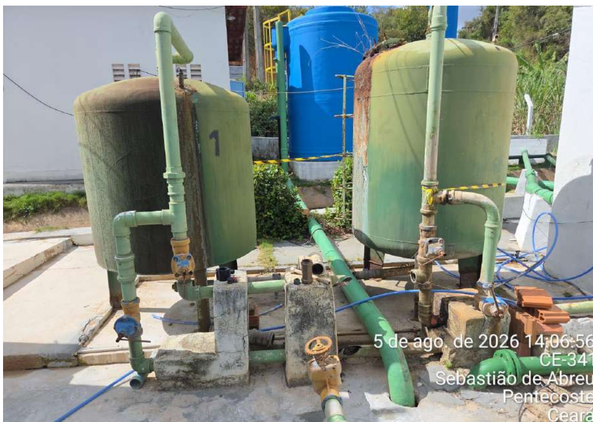
Foto 53 - ETA Sebastião de Abreu: filtros de pressão com fluxo descendente e tubulações desativados, sem desmobilização adequada.
