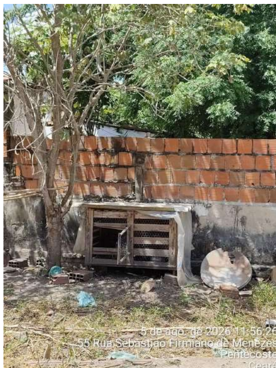
Foto 22 - REL-02(Sede): presença de estrutura destinada à criação de galinhas no interior da área operacional, em condições precárias de conservação e higiene.
