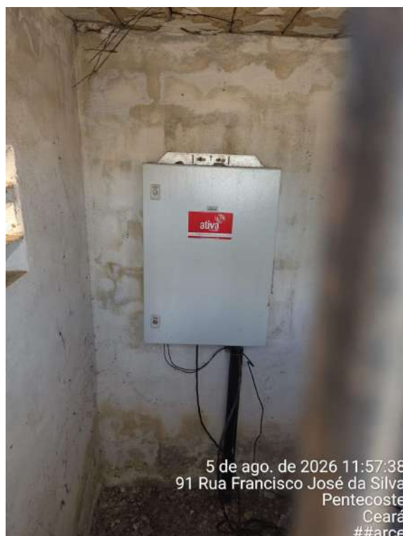
Foto 20 - REL-02 (Sede): quadro elétrico com fiação exposta, desorganizada e proteção inadequada.
