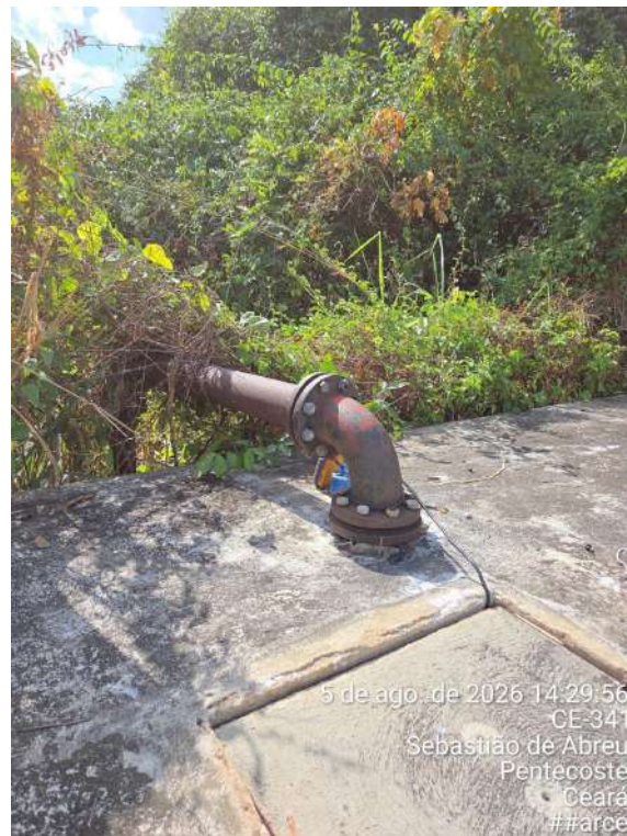
Foto 93 - RAP-01 (Sebastião de Abreu): vegetação excessiva no entorno do RAP, tubulação com sinais de oxidação, fiação exposta sobre a laje sem proteção ou fixação adequada, além de deterioração do revestimento da laje.
