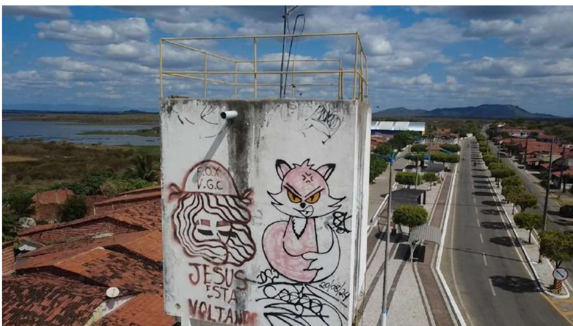
Foto 43 - REL-03 (Sede): tubulação de extravasamento sem tela ou dispositivo de proteção na extremidade, deterioração do revestimento e presença de manchas de umidade.
