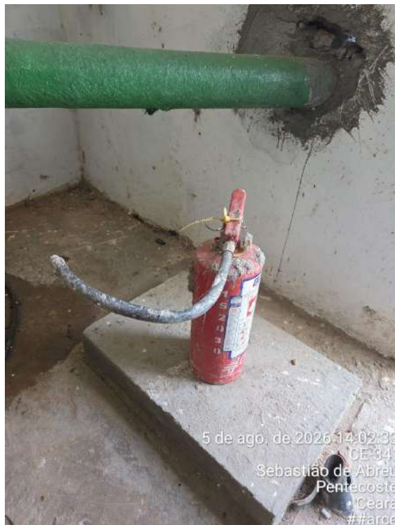
Foto 63 - ETA Sebastião de Abreu : casa de bomba com extintor de incêndio disposto inadequadamente sobre o piso, sem suporte e sinalização apropriados, apresentando sinais de deterioração e sujeira, além de vedação inadequada na passagem da tubulação pela parede, com falhas no acabamento e abertura ao redor da tubulação.
