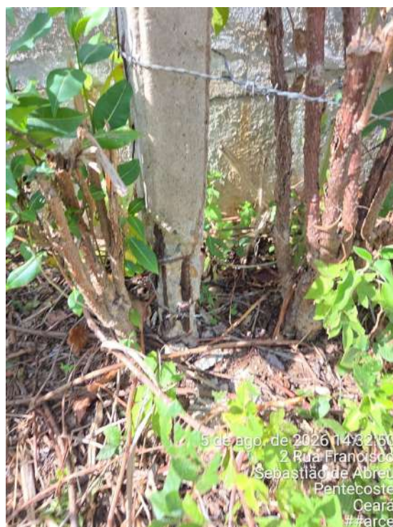
Foto 91 - RAP-01 (Sebastião de Abreu): estrutura de concreto do mourão da cerca perimetral deteriorada, com desprendimento do revestimento e presença de vegetação junto à base.
