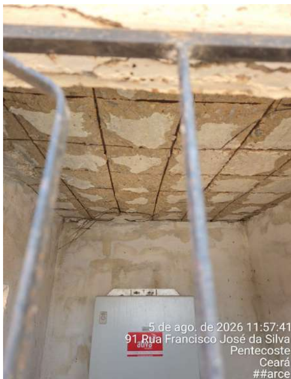
Foto 21 - REL-02(Sede): laje de cobertura da casa de comando com deterioração acentuada da estrutura, armaduras expostas e sinais de corrosão.
