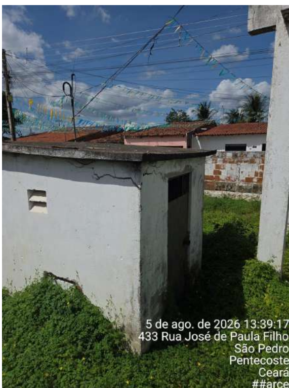
Foto 37 - REL-03 (Sede): presença de vegetação no interior da área operacional e deterioração da casa de comando, com presença de fissuras em sua estrutura.
