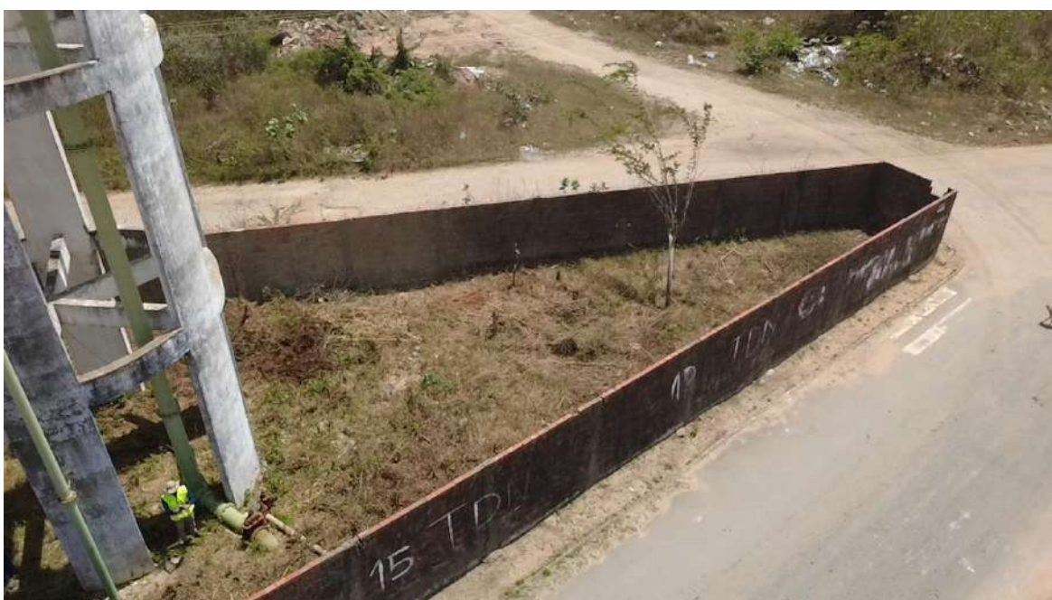
Foto 45 - REL-04 (Sede): presença de vegetação, raízes e tocos expostos.
