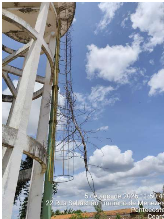
Foto 6 - REL-02(Sede): escada fixa com corrosão, com gaiola de proteção deformada e com presença de vegetação seca entrelaçada à estrutura.
