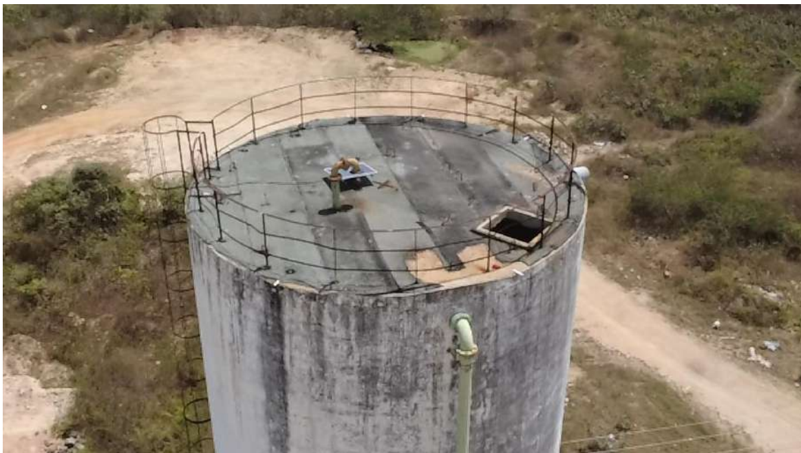
Foto 46 - REL-04 ( Sede ): guarda-corpo com sinais de corrosão, deterioração do revestimento e tampa de acesso ao reservatório aberta, comprometendo a vedação.
