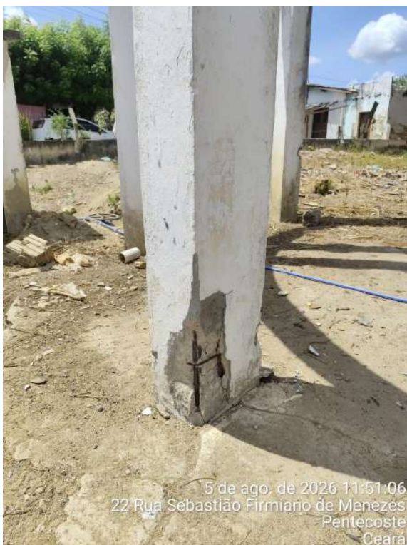
Foto 9 - REL-02 (Sede): pilar com deterioração e perda do revestimento, armadura exposta e sinais de corrosão.
