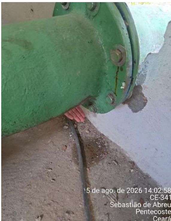
Foto 61 - ETA Sebastião de Abreu : sinais de vazamento na conexão da tubulação; parede danificada.
