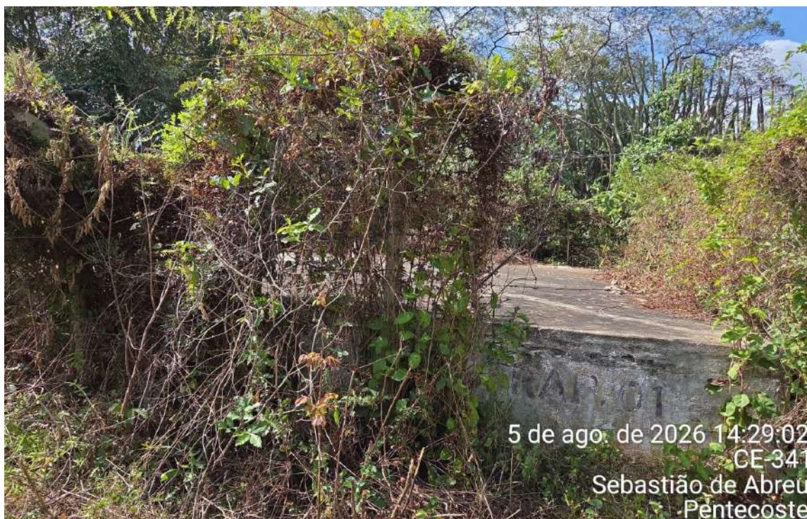
Foto 87 - RAP-01 (Sebastião de Abreu): vegetação excessiva no entorno do RAP e deterioração do revestimento da parede, associado a presença de fissuras.
