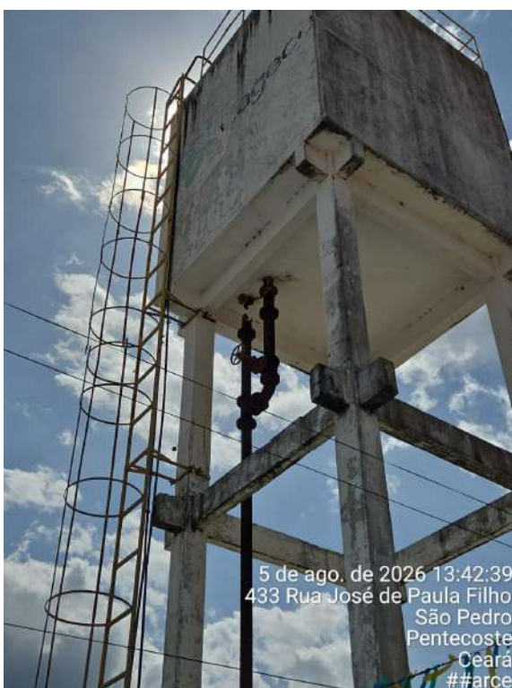
Foto 33 - REL-03 (Sede): deterioração do revestimento, tubulação e escada fixa com sinais de corrosão.
