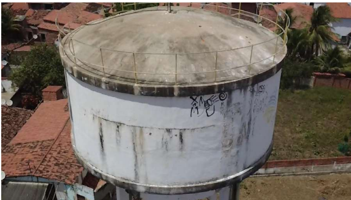
Foto 2 - REL-02 (Sede): sinais de umidade e deterioração do revestimento da parede, associado a presença de fissuras.
