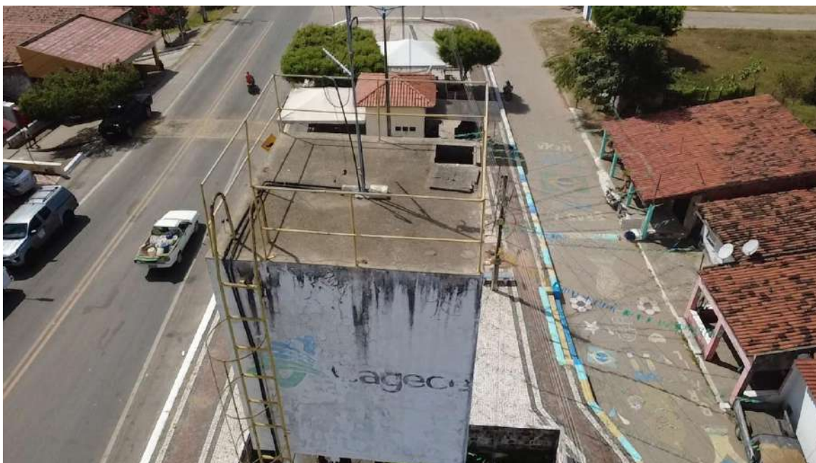
Foto 42 - REL-03 (Sede): guarda-corpo com sinais de corrosão, deterioração do revestimento e tampa de acesso ao reservatório aberta, comprometendo a vedação.
