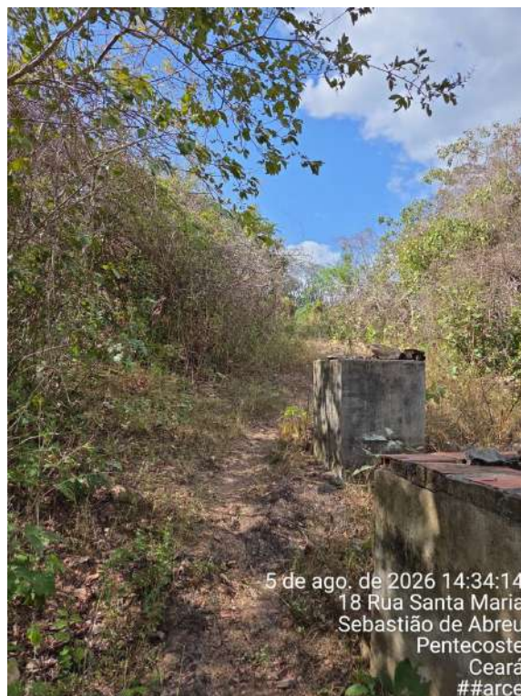
Foto 86 - RAP-01 (Sebastião de Abreu): acesso íngreme e precário, com terreno irregular e com vegetação densa, além de caixas de passagem deterioradas, com sinais de comprometimento das estruturas.
