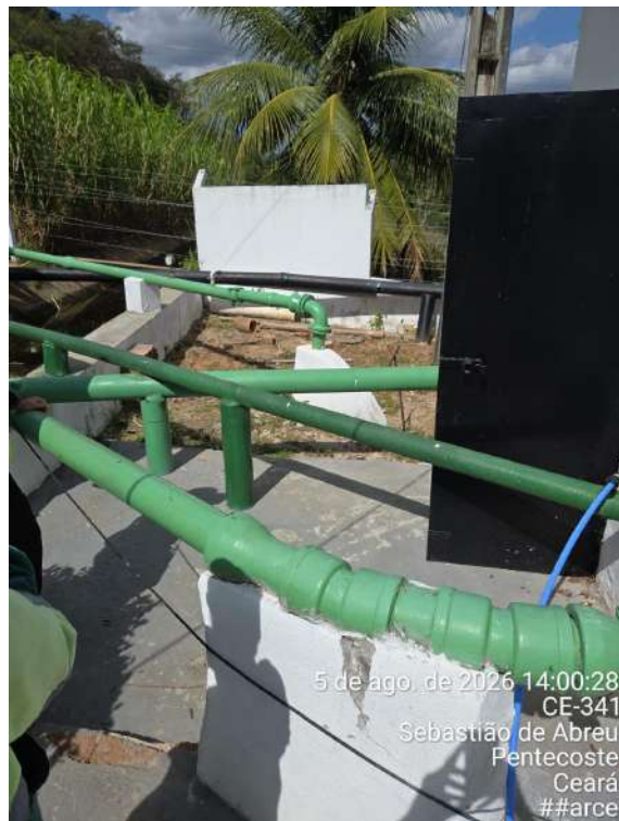
Foto 67 - ETA Sebastião de Abreu: acesso a casa de bomba dificultado pela presença de tubulações na área de circulação e acesso operacional.
