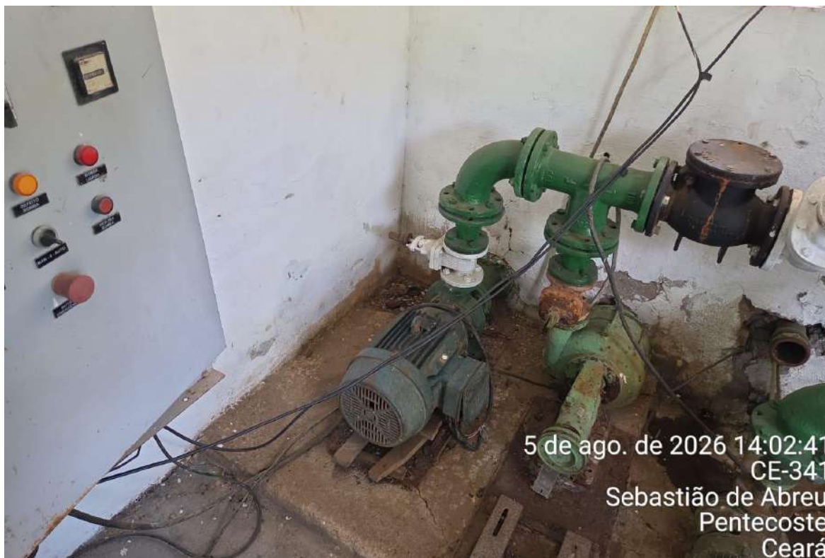
Foto 57 - ETA Sebastião de Abreu: conjunto motobomba sem proteção adequada no acoplamento, apresentando sinais de corrosão, fiação exposta e desorganizada, piso com fissuras e sujidades, além de deterioração do revestimento das paredes.
