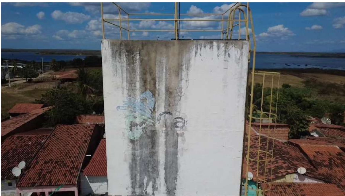
Foto 32 - REL-03 (Sede): deterioração do revestimento.
