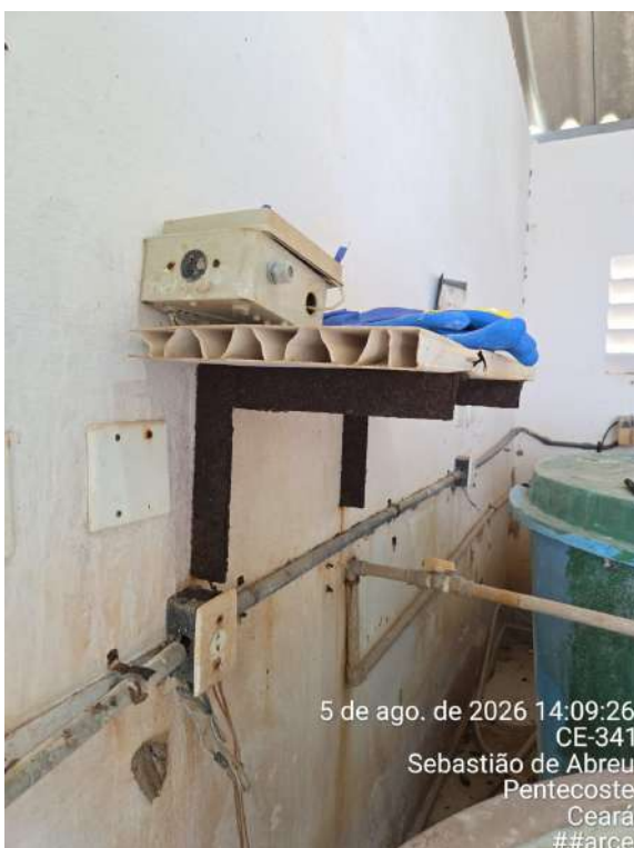
Foto 76 - ETA Sebastião de Abreu: instalações elétricas deterioradas, com fiação aparente, componentes corroídos e suporte improvisado para equipamentos e materiais.
