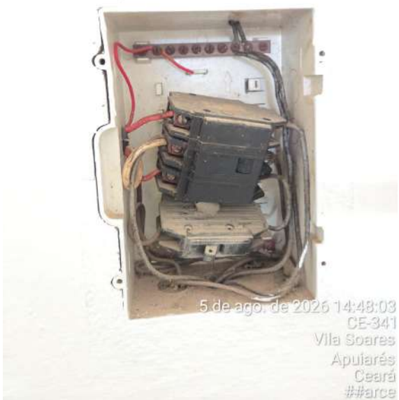
Foto 97 - RSE-02 (Sebastião de Abreu): quadro elétrico sem tampa, com componentes e fiação expostos.
