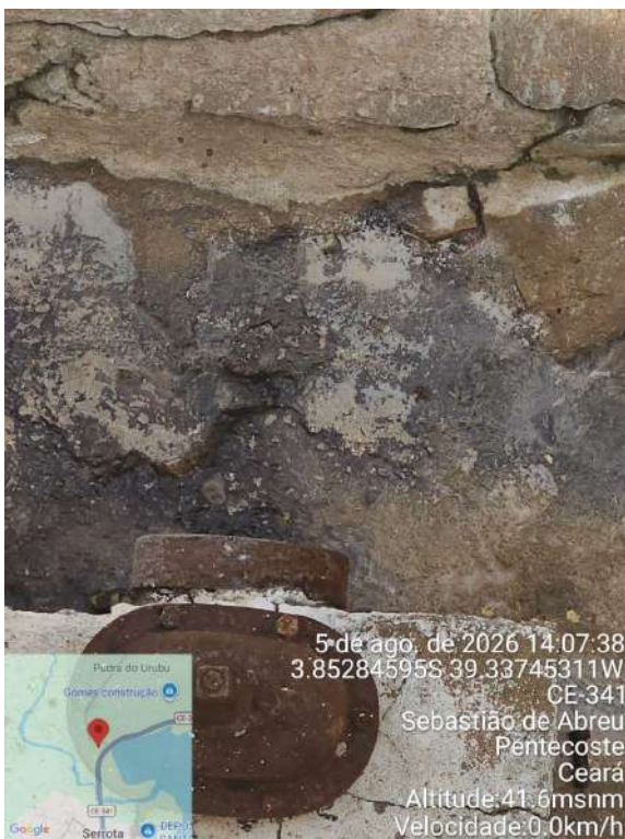
Foto 54 - ETA Sebastião de Abreu: sinais de vazamento no registro de descarga de lavagem dos filtros.
