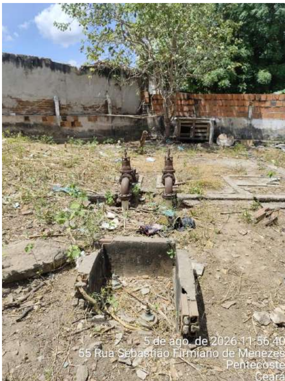
Foto 17 - REL-02 (Sede): acúmulo de resíduos, entulho e vegetação, caixa de passagem danificada, além de tubulações e registros desativados, sem desmobilização adequada.
