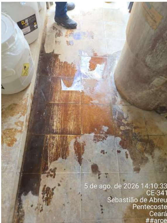
Foto 66 - ETA Sebastião de Abreu: acúmulo de água/solução química, oriundo de vazamentos, no piso da casa de química.
