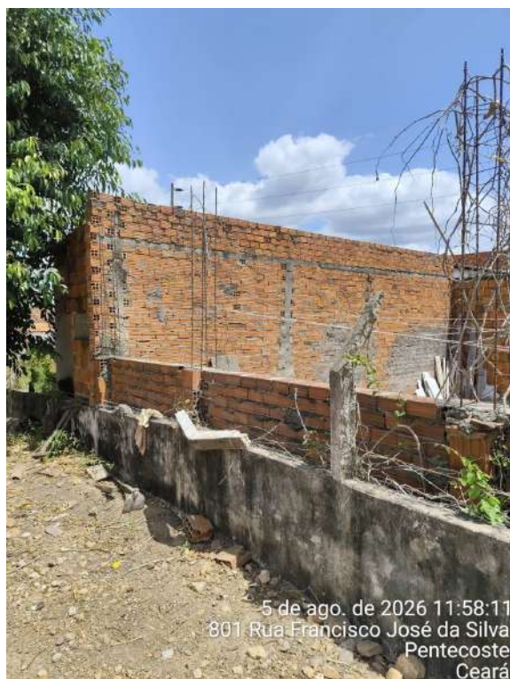
Foto 16 - REL-02 (Sede): acúmulo de entulho e cercamento incompleto, com mourões danificados e quantidade insuficiente de arames.
