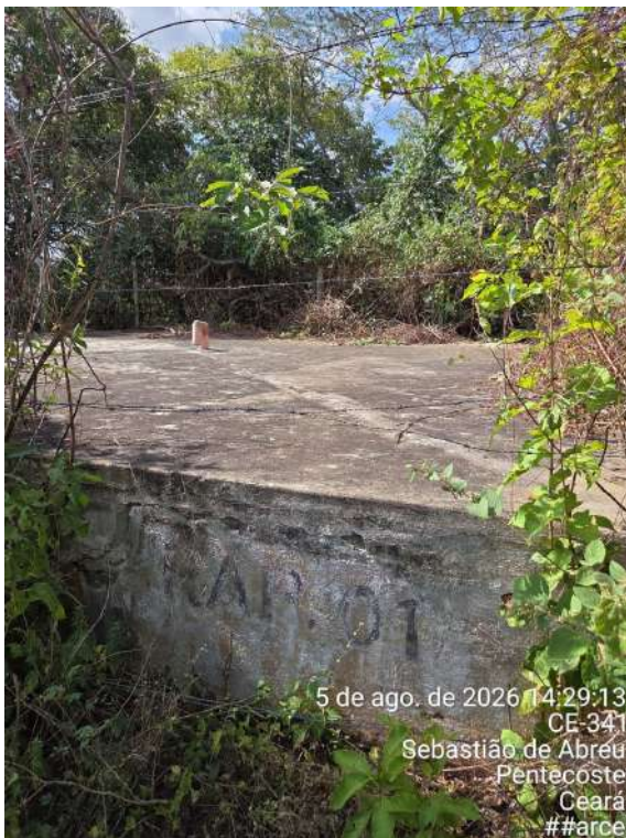
Foto 88 - RAP-01 (Sebastião de Abreu): vegetação excessiva no entorno do RAP e deterioração do revestimento da parede, associado a presença de fissuras.
