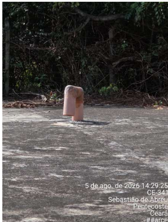
Foto 89 - RAP-01 (Sebastião de Abreu): suspiro do RAP sem tela de proteção, revestimento da laje superior deteriorado, com presença de lodo e vegetação no entorno.
