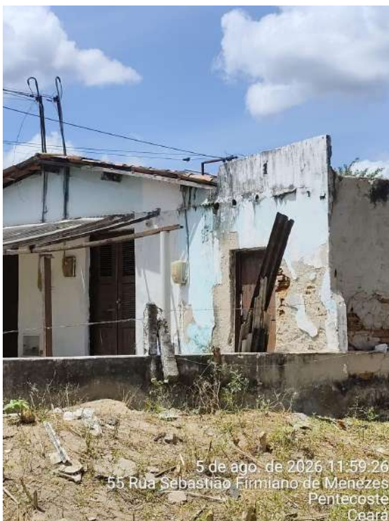
Foto 5 - REL-02 (Sede): acúmulo de resíduos sólidos, vegetação, entulho e cercamento deficiente, com mourões danificados e quantidade insuficiente de arames.
