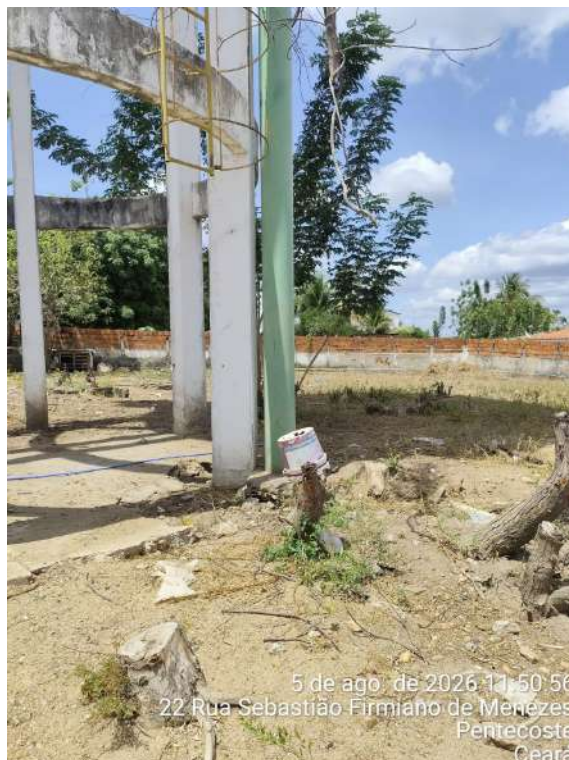
Foto 12- REL-02 (Sede): piso e terreno irregulares, presença de resíduos, raízes e tocos expostos, prejudicando o acesso à escada.
