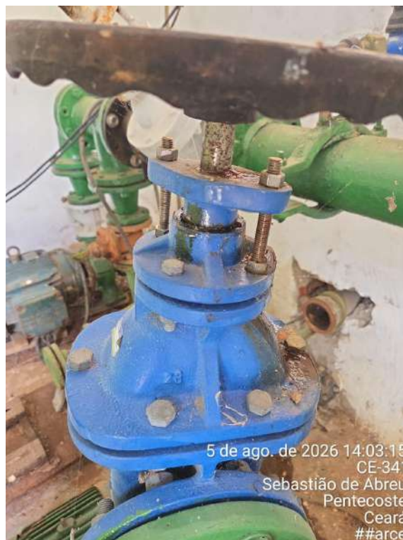
Foto 65 - ETA Sebastião de Abreu : indícios de vazamento na válvula, com acúmulo de água na conexão.
