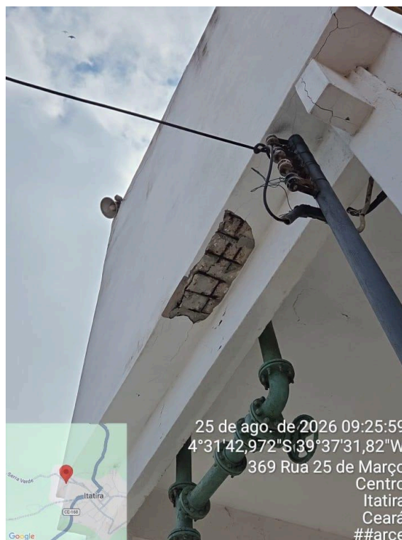
Foto 52 - REL-01 (Sede): estrutura com revestimento deteriorado, apresentando desprendimento de material e exposição da armadura, tubulação com sinais de oxidação.
