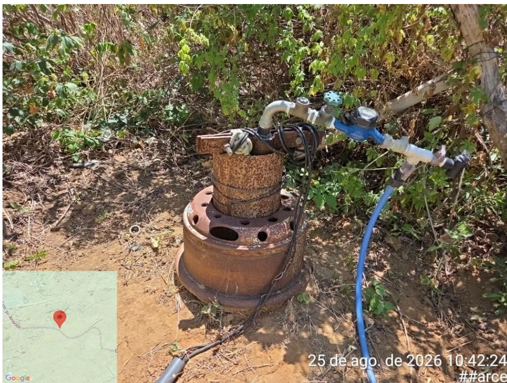
Foto 28 - PT-06 (Sede): estrutura metálica apoiada sobre base improvisada, com acentuados sinais de corrosão, fiação e mangueira expostas e dispostas de forma desorganizada, além de presença de vegetação densa no entorno.
