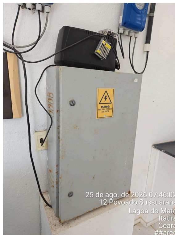
Foto 19 - Casa de química (ETA - Lagoa do Mato ): quadro elétrico com sinais de corrosão, fiação aparente e desorganizada, além de equipamentos e fonte de alimentação instalados de forma inadequada sobre a parte superior do quadro.
