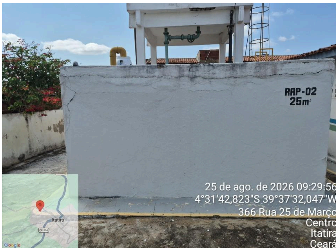
Foto 47 - RAP-02 ( Sede ): estrutura com presença de fissuras e trincas, além de sinais de umidade.
