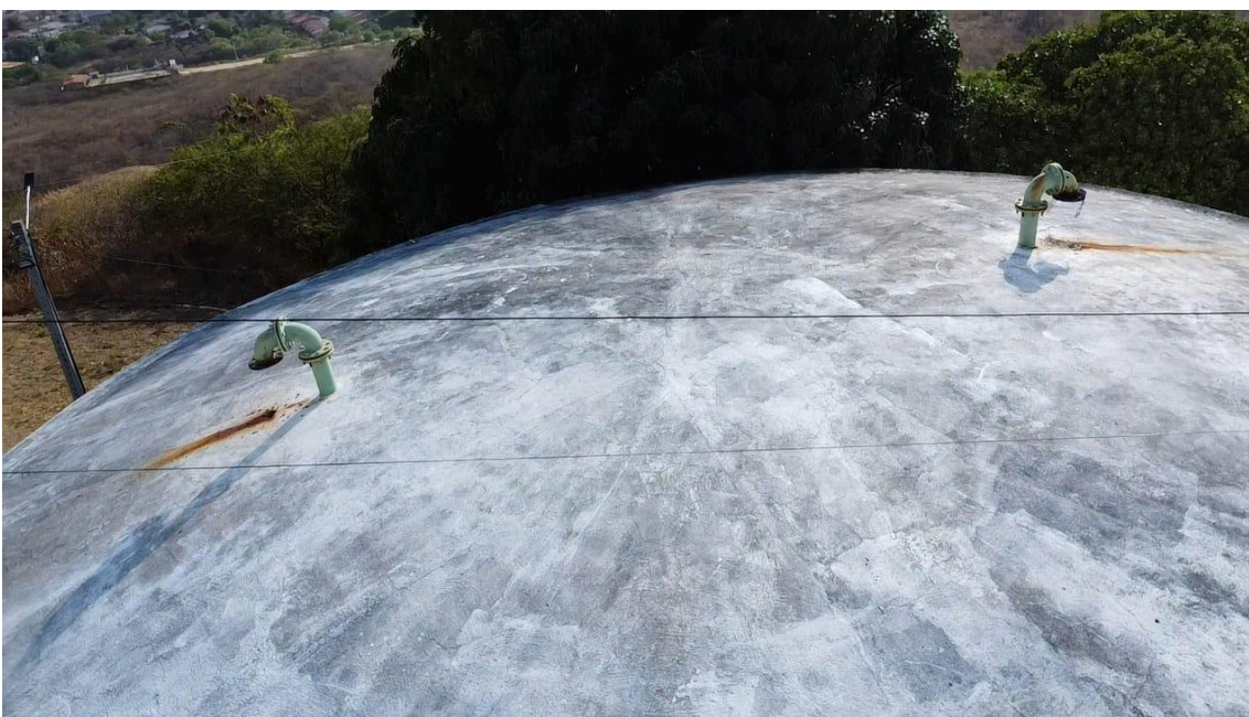
Foto 8 - RSE-01 (ETA - Lagoa do Mato): suspiros sem tela ou dispositivo de proteção.
