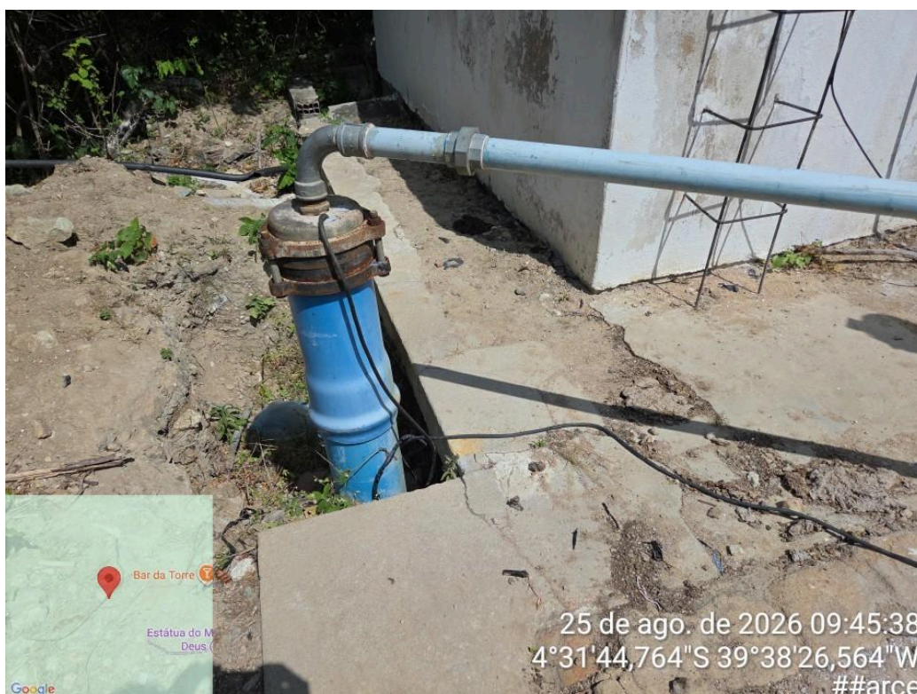
Foto 44 - RAP-01 (Sede): tubulação e conexões metálicas com corrosão, fiação elétrica exposta e disposta inadequadamente sobre o solo, além de deterioração do piso e presença de sujidades e vegetação na área operacional.
