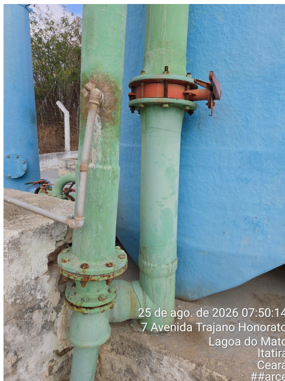
Foto 22 - Filtro 1 (ETA - Lagoa do Mato): tubulações, parafusos e registro com sinais de corrosão, além de deterioração da estrutura de apoio em concreto.
