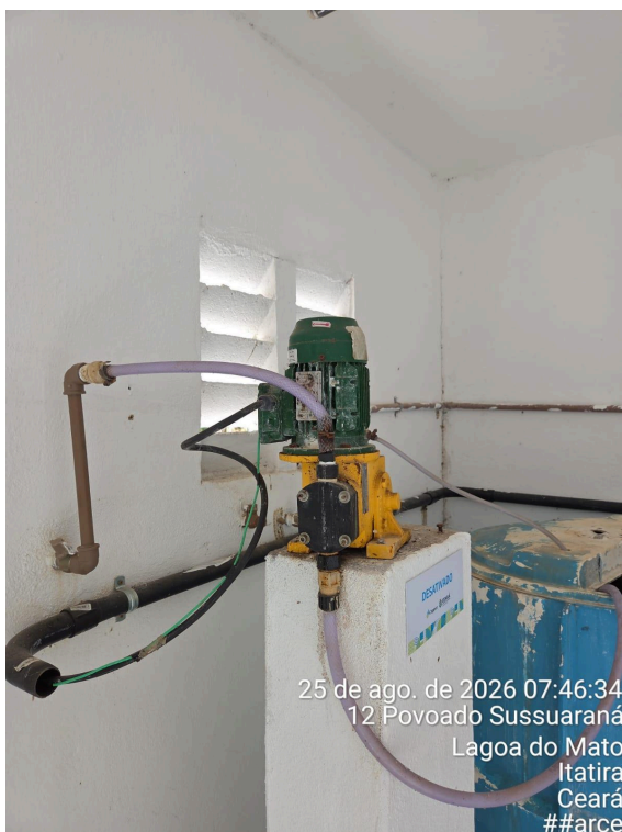
Foto 18 - Casa de química (ETA - Lagoa do Mato ): equipamento de dosagem com mangueiras e fiação elétrica aparentes e dispostas de forma desorganizada, além de sinais de deterioração e corrosão nos componentes e estruturas adjacentes.
