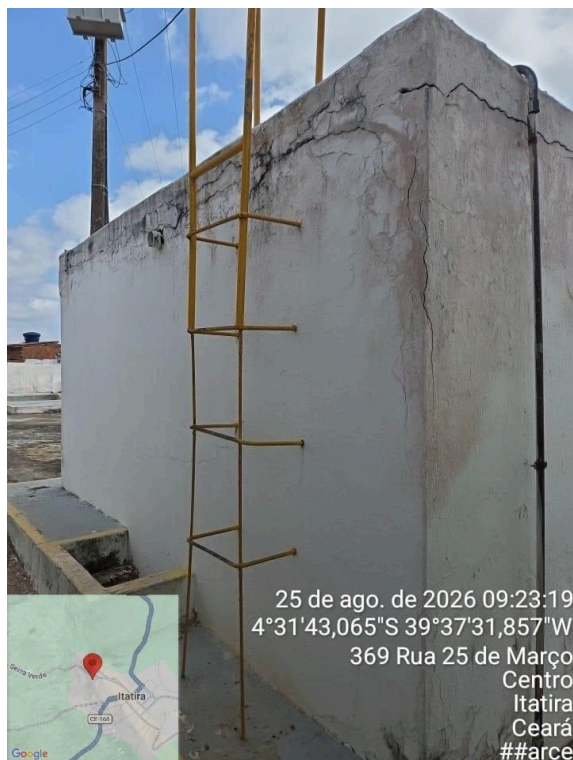
Foto 49 - RAP-02 ( Sede ): estrutura com fissuras e trincas, sinais de umidade, revestimento deteriorado e escada metálica com sinais de corrosão, sem proteção adequada contra quedas.
