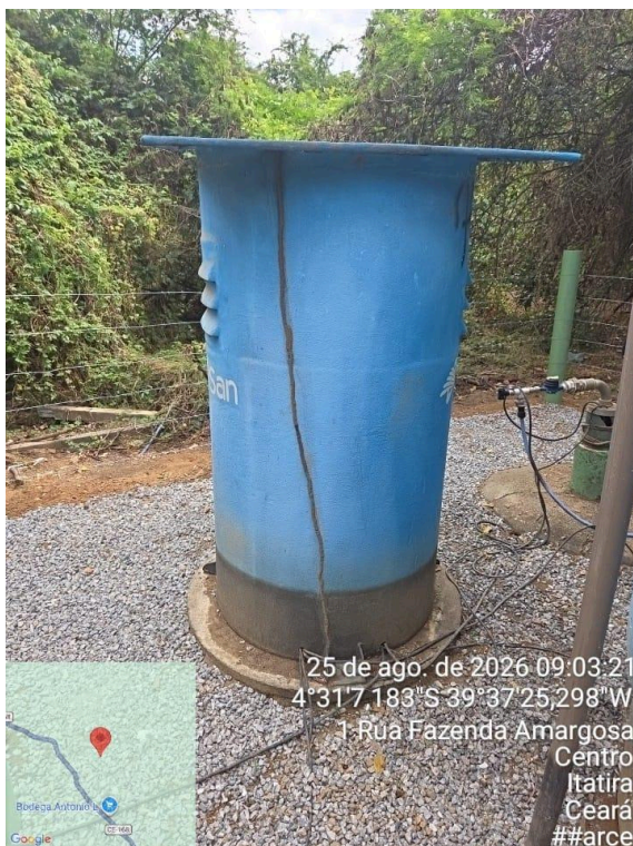
Foto 39 - PT-14 (Sede): mangueira e fiação elétrica expostas, dispostas de forma desorganizada diretamente sobre o solo, em área destinada à circulação e ao acesso operacional, além da presença de caminhos/estruturas sugestivos de infestação por cupins.
