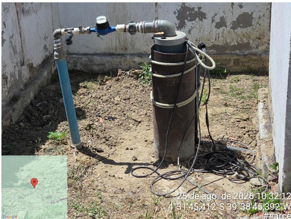
Foto 29 - PT-09 (Sede): tubulações e conexões com sinais de corrosão, amarração improvisada, fiação exposta e disposta de forma desorganizada sobre o solo, além de parede e piso deteriorados.
