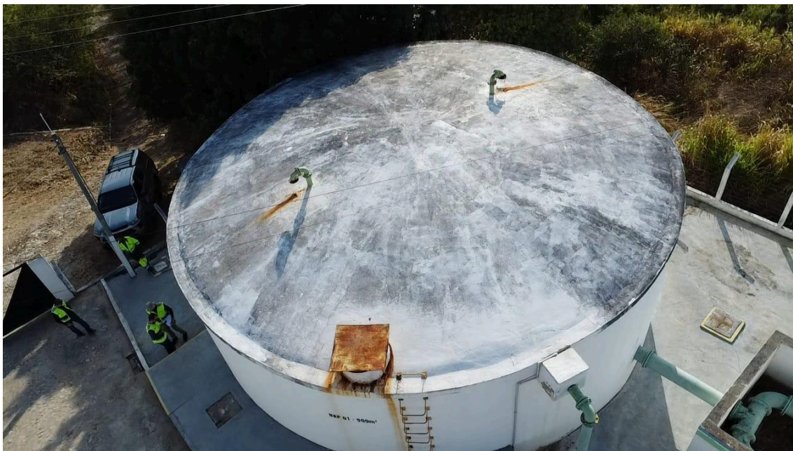
Foto 7 - RSE-01 (ETA - Lagoa do Mato): tampa de acesso metálica com sinais de corrosão, manchas de oxidação na estrutura adjacente, além de deterioração do revestimento da cobertura.
