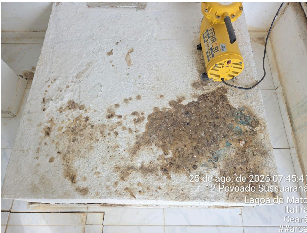
Foto 16 - Casa de química (ETA - Lagoa do Mato ): superfície de apoio com presença de sujidades, manchas e incrustações.
