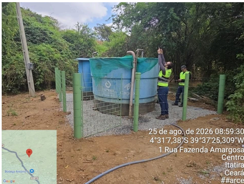
Foto 37 - PT-14 (Sede): ausência de identificação da unidade, mangueira disposta de forma inadequada diretamente sobre o solo, em área destinada à circulação e ao acesso operacional.
