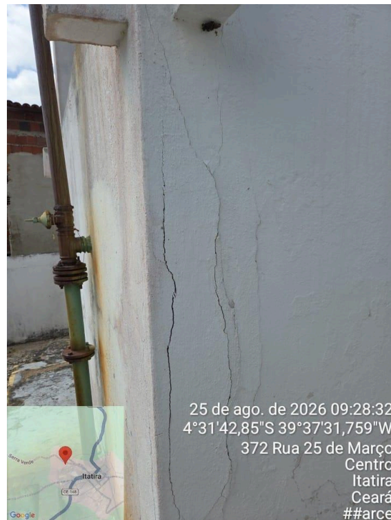
Foto 56 - EEAT-01 (Sede): estrutura com presença de fissuras.
