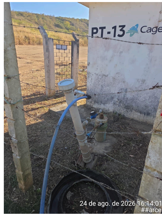
Foto 34 - PT-13 (Sede): tubulação de dosagem de cloro apoiada de forma improvisada, mangueira disposta inadequadamente através do cercamento perimetral, presença de sujeidades no entorno, fios de arame frouxos e desalinhados, além de parede com sinais de umidade e deterioração do revestimento.
