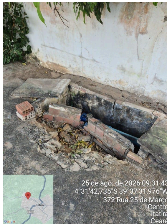
Foto 58 - Área de circulação e acesso operacional do SSD-01 (Sede): caixa do macromedidor com estrutura deteriorada, apresentando danos nos elementos de fechamento, além da presença de resíduos em seu interior e entorno.
