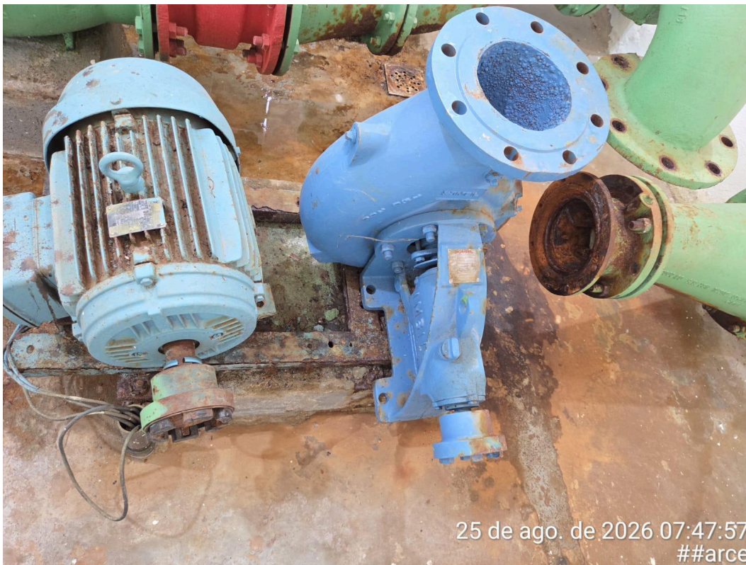
Foto 15 - EELF-01 (ETA - Lagoa do Mato ): conjunto motobomba desmontado e mantido exposto na área operacional, com componentes metálicos apresentando sinais de corrosão, além de acúmulo de água, presença de sujidades e corrosão na base de apoio.
