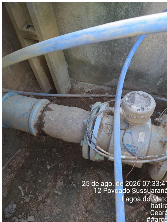
Foto 13 - Adutora (ETA - Lagoa do Mato): macromedidor e tubulação com acúmulo de sujidades, mangueira e fiação elétrica aparentes e dispostas de forma desorganizada junto ao equipamento, além de indícios de vazamento e presença de resíduos na área operacional.
