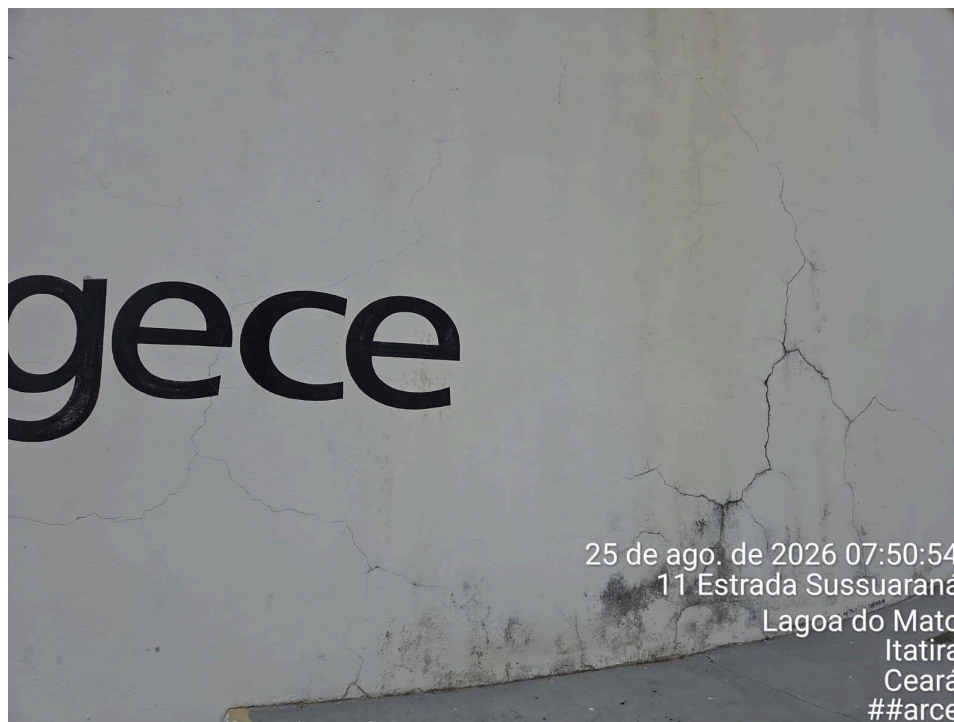
Foto 9 - RSE-01 (ETA - Lagoa do Mato ): parede com fissuras e trincas, além de sinais de umidade e deterioração do revestimento na região inferior.
