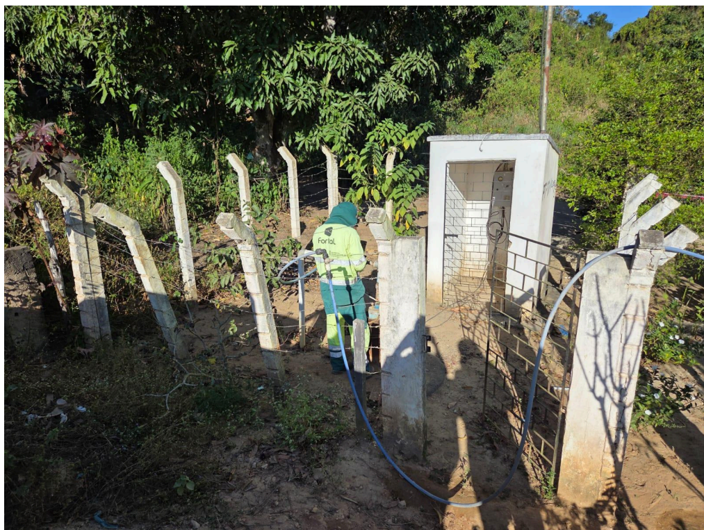
Foto 31 - PT-11 ( Sede ): cercamento perimetral deteriorado, com mourões inclinados e danificados, presença de vegetação, portão em condições inadequadas e mangueira disposta indevidamente sobre a área de acesso operacional.
