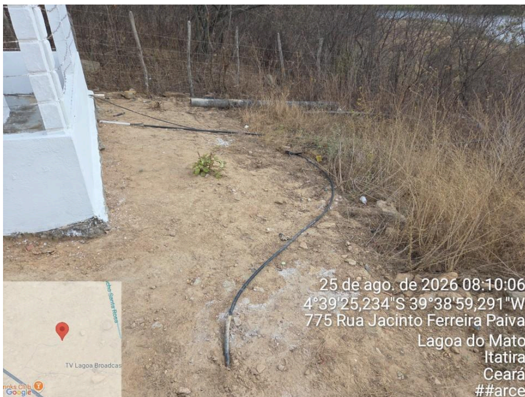
Foto 6 - Casa de comando (Açude João Silva Guerra - Lagoa do Mato ): fiação elétrica exposta e disposta de forma inadequada sobre o solo, em área de circulação e acesso operacional, além da presença de vegetação e de sujidades no entorno.
