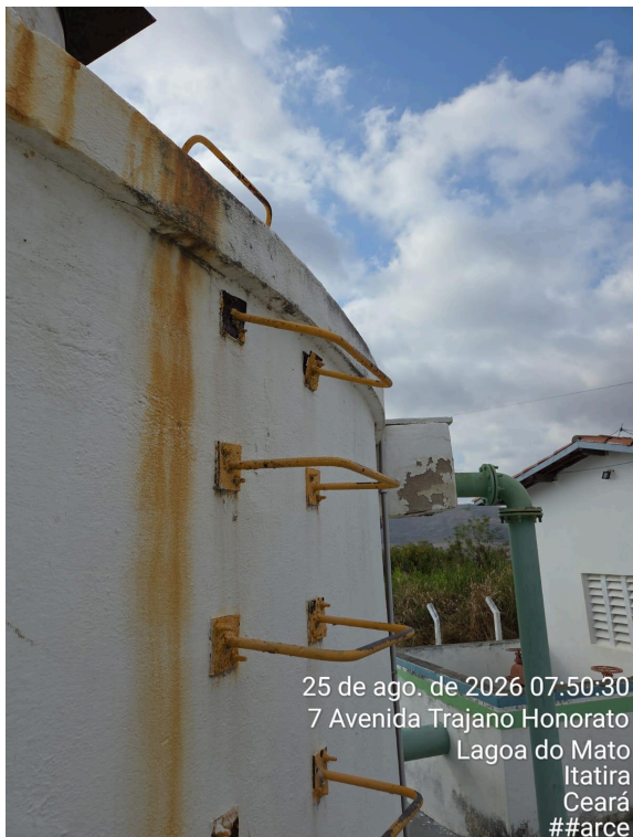
Foto 12 - RSE-01 (ETA - Lagoa do Mato): escada de acesso com sinais de corrosão nos degraus e pontos de fixação, presença de manchas de oxidação e sinais de umidade no revestimento.
