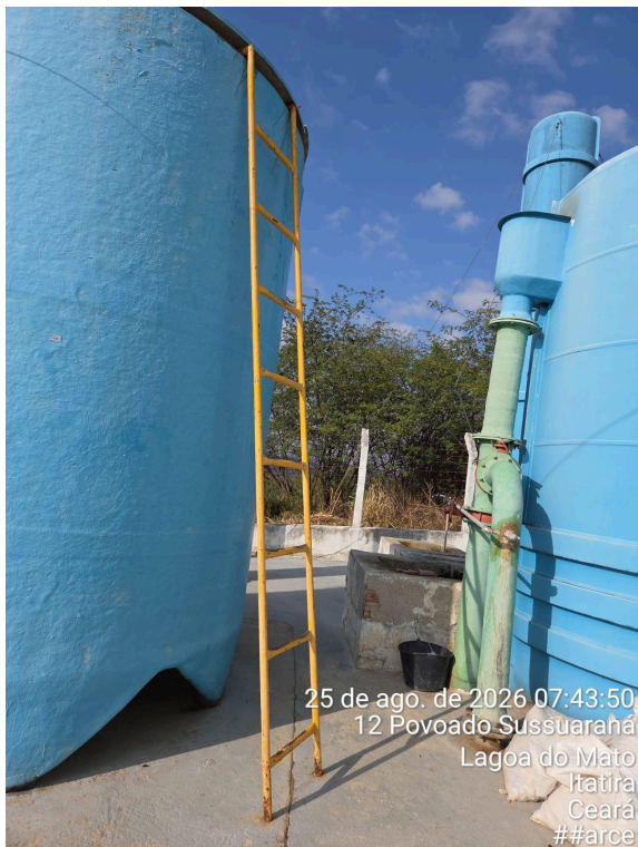
Foto 20 - Filtro 1 (ETA - Lagoa do Mato): escada de acesso improvisada, sem fixação adequada e sem dispositivos de proteção contra quedas, além de apresentar sinais de corrosão.
