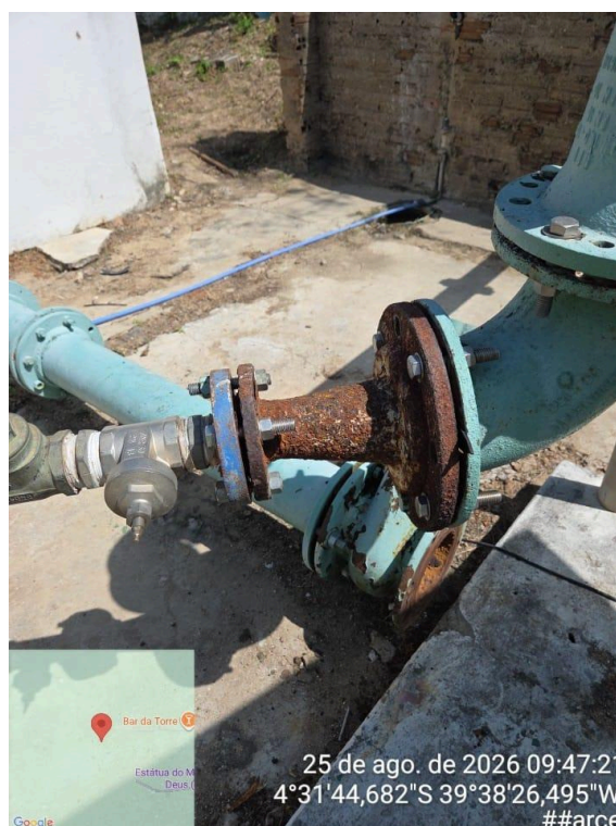
Foto 46 - RAP-01 (Sede): tubulação e conexões metálicas com sinais de corrosão, além de deterioração do piso.
