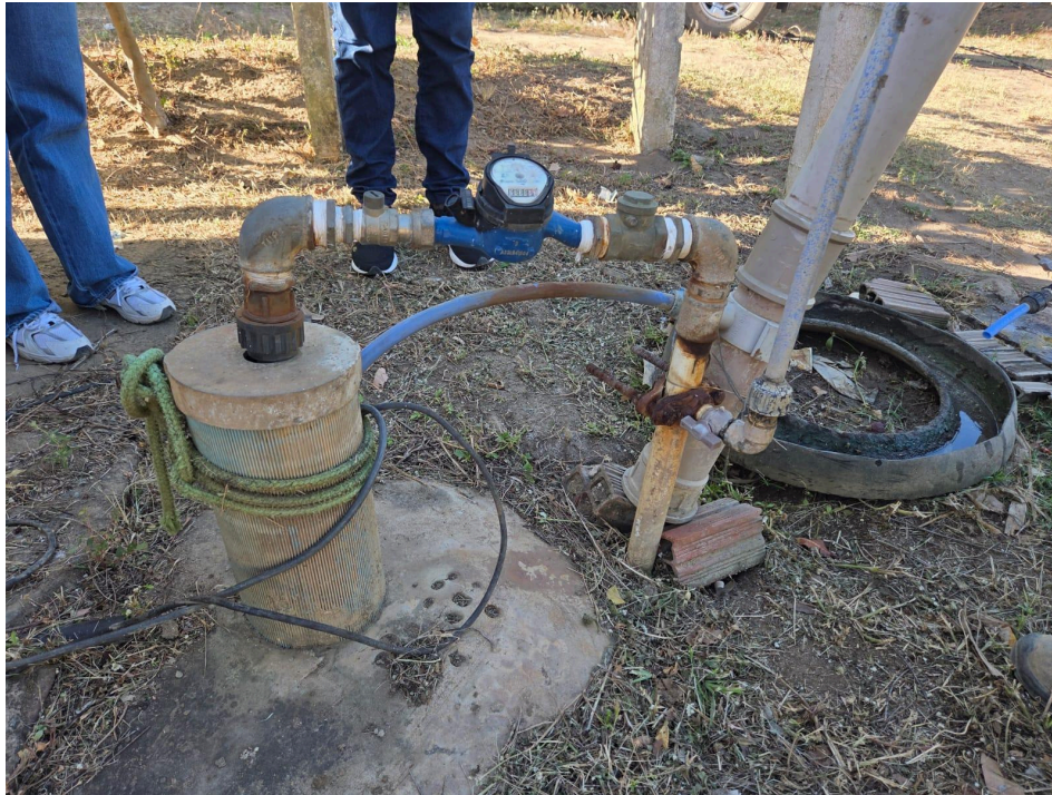
Foto 32 - PT-13 (Sede): tubulações, conexões e registro com sinais de corrosão, mangueiras e fiação dispostas de forma desorganizada sobre o solo, tubulação de dosagem de cloro apoiada de forma improvisada sobre tijolos, além da presença de acúmulo de água e sujeidades na área adjacente.
