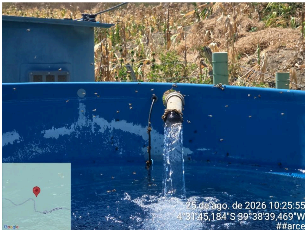
Foto 26 - PT-04 (Sede): reservatório sem cobertura adequada, com presença de abelhas em seu interior e entorno, além de fiação elétrica aparente.
