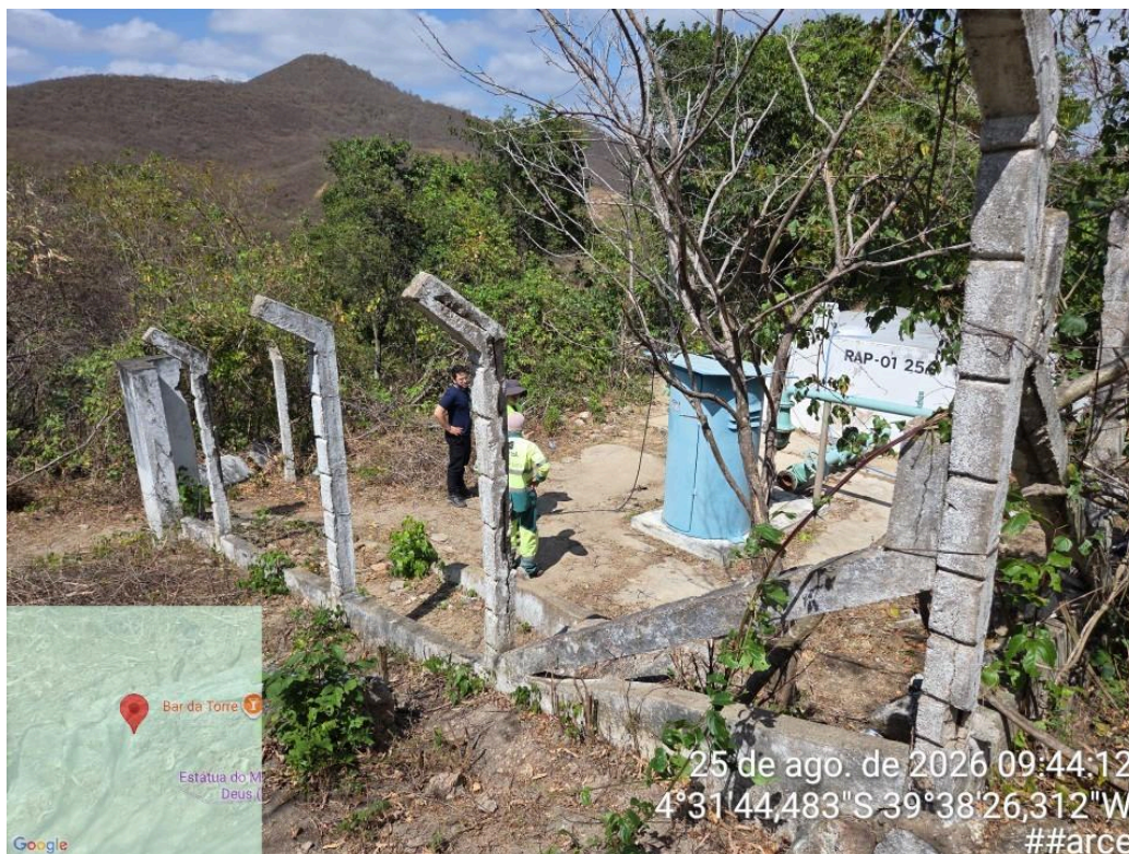
Foto 43 - RAP-01 (Sede): cercamento perimetral deteriorado, com ausência de fios de arame, fiação elétrica disposta inadequadamente sobre o solo, em área destinada à circulação e ao acesso operacional, além da presença de vegetação.
