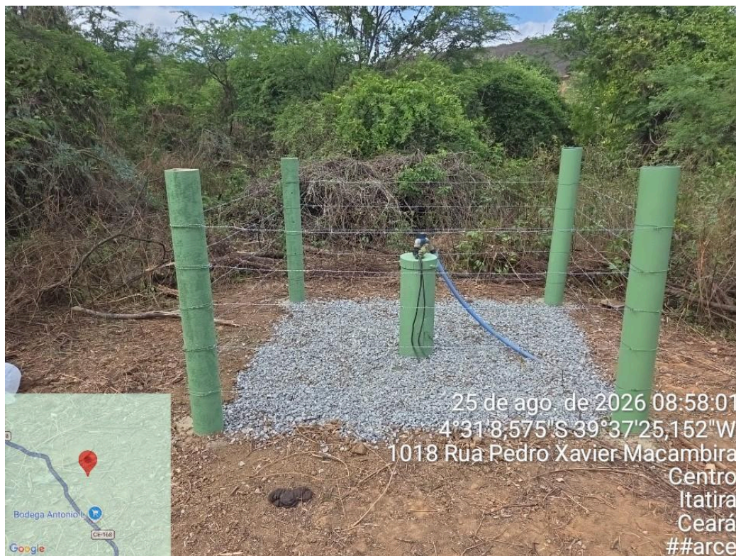
Foto 41 - PT-15 (Sede): ausência de acesso operacional e de identificação da unidade.
