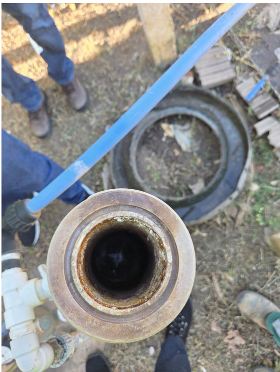
Foto 35 - PT-13 (Sede): poço em operação com sistema de dosagem de cloro desprovido de pastilhas de cloro.
