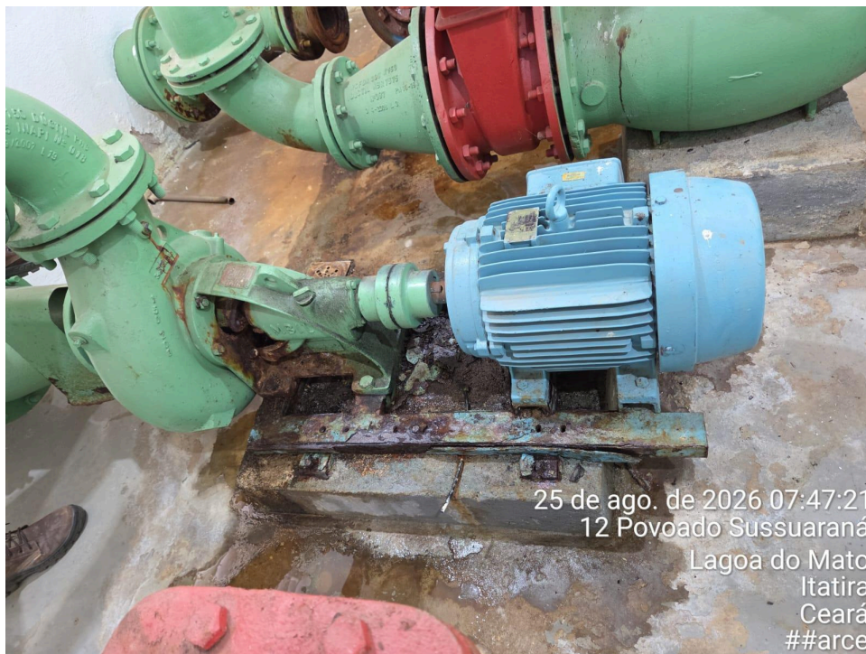
Foto 14 - EELF-01 (ETA - Lagoa do Mato): conjunto motobomba com sinais de corrosão na base de apoio e componentes metálicos, além de indícios de vazamento e acúmulo de água no piso.
