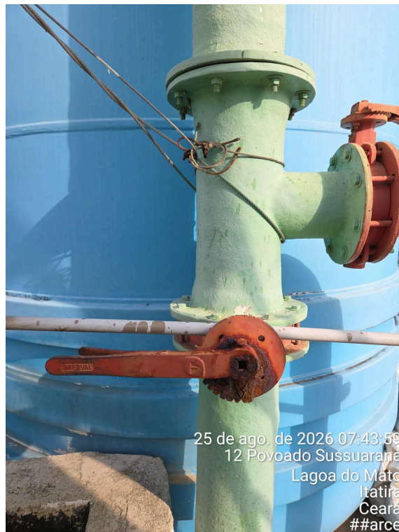
Foto 21 - Filtro 1 (ETA - Lagoa do Mato): cabo de aço fixado de forma improvisada à tubulação, registro com sinais de corrosão.
