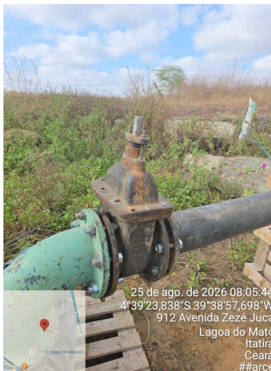
Foto 4 - Captação (Açude João Silva Guerra - Lagoa do Mato ): registro e demais componentes metálicos com sinais de corrosão, apoio inadequado e improvisado da estrutura, além da presença de vegetação.
