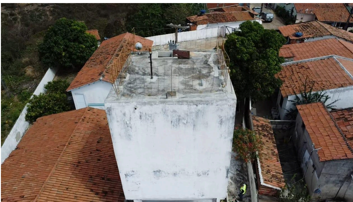
Foto 54 - REL-01 (Sede): deterioração do revestimento, presença de manchas de umidade e fissuras na estrutura.
