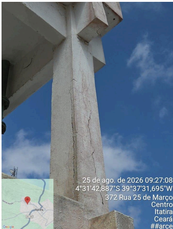
Foto 55 - REL-01 (Sede): pilar estrutural com fissuras e trincas longitudinais.
