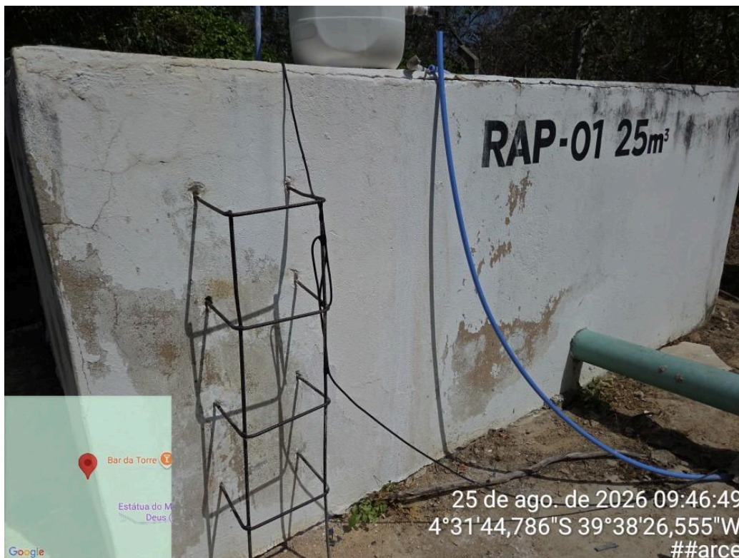
Foto 45 - RAP-01 (Sede): parede com revestimento deteriorado e sinais de umidade, escada metálica de acesso com corrosão, mangueira e fiação expostas e dispostas de forma desorganizada, além de deterioração do piso e presença de sujidades na área operacional.
