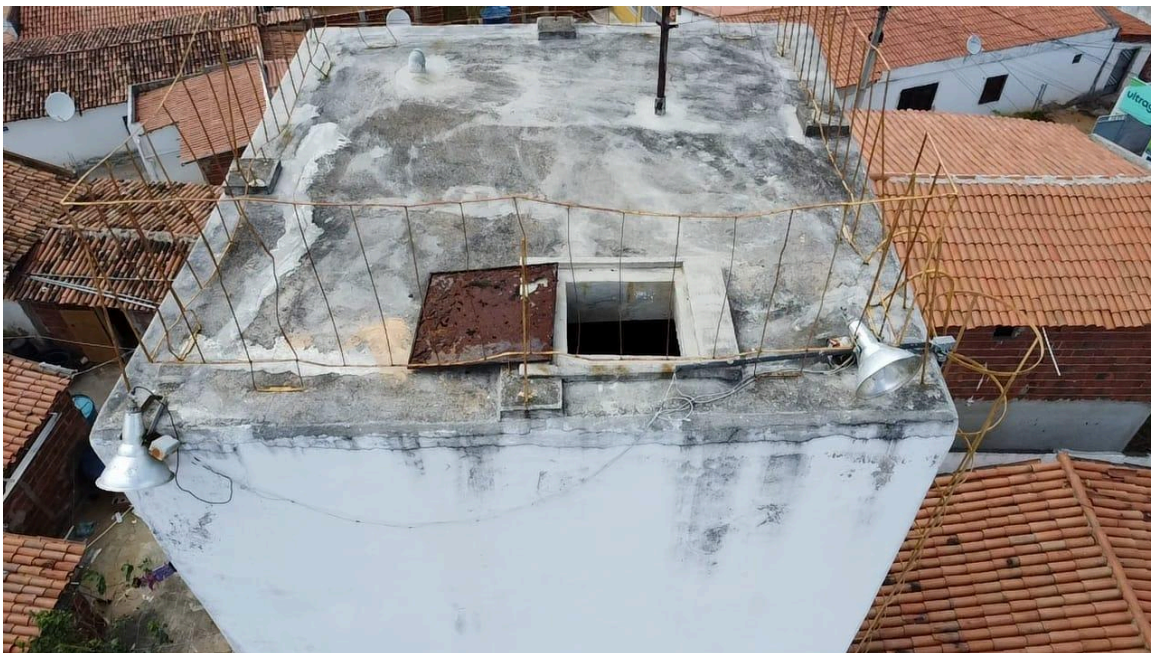
Foto 53 - REL-01 (Sede): cobertura com abertura de acesso destampada e tampa metálica com sinais de corrosão, guarda-corpo deteriorado e com trechos sem proteção adequada, fiação disposta de forma desorganizada, deterioração do revestimento, sinais de umidade e fissuras na estrutura.
