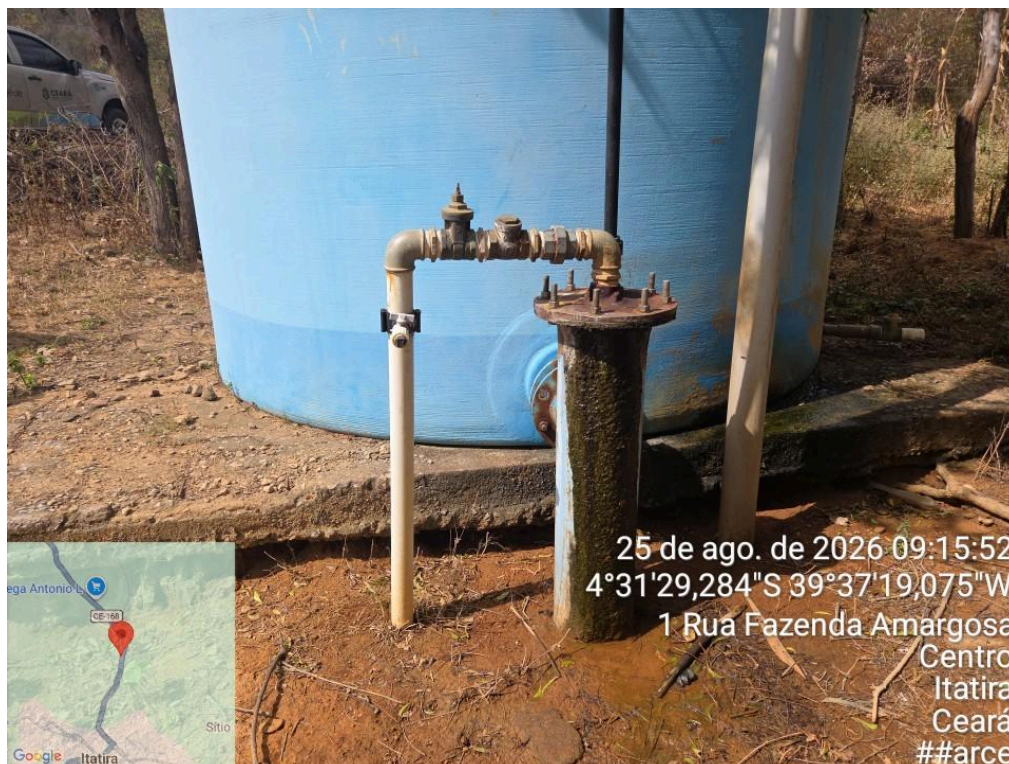
Foto 51 - RAP-03 (Sede): tubulações, conexões e componentes metálicos com sinais de corrosão e de vazamento.
