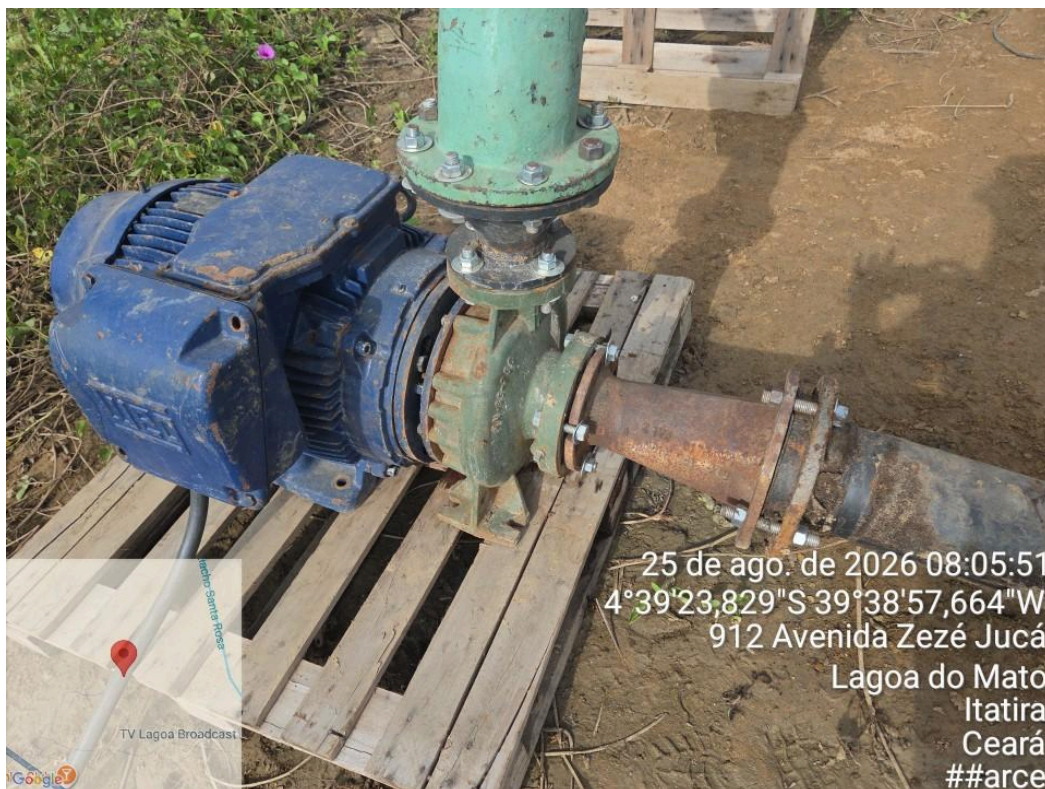
Foto 5 - Captação (Açude João Silva Guerra - Lagoa do Mato ): conjunto motobomba apoiado de forma inadequada e improvisada, com tubulação e componentes metálicos apresentando sinais de corrosão.
