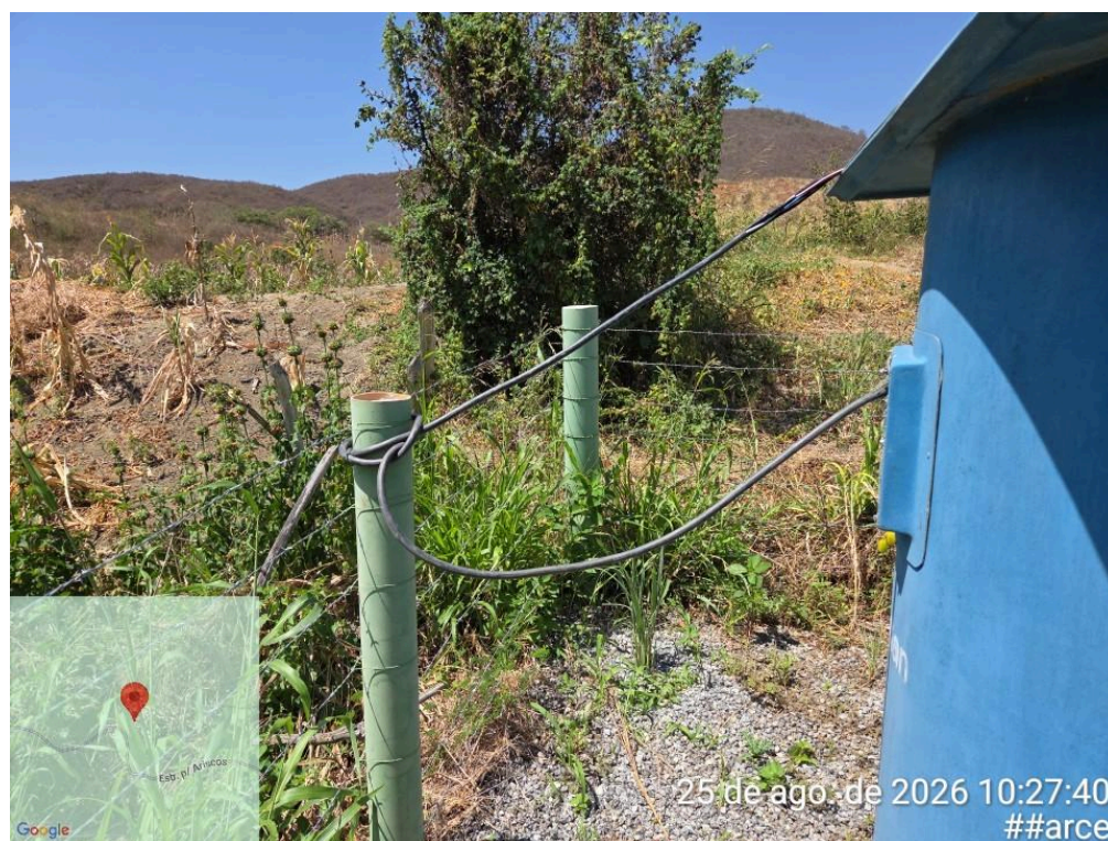
Foto 27 - PT-04 (Sede): fiação elétrica exposta e disposta de forma inadequada sobre o cercamento perimetral, com cabos apoiados e entrelaçados ao mourão, além de presença de vegetação.
