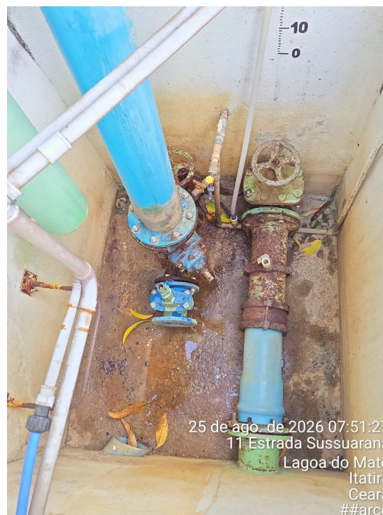
Foto 11 - RSE-01 (ETA - Lagoa do Mato ): caixa de manobra com tubulações, registros e demais componentes metálicos apresentando sinais de corrosão, ocorrência de vazamento e acúmulo de água no piso, componente desmontado mantido na área operacional, presença de sujidades, além de ausência de escada adequada para acesso operacional.
