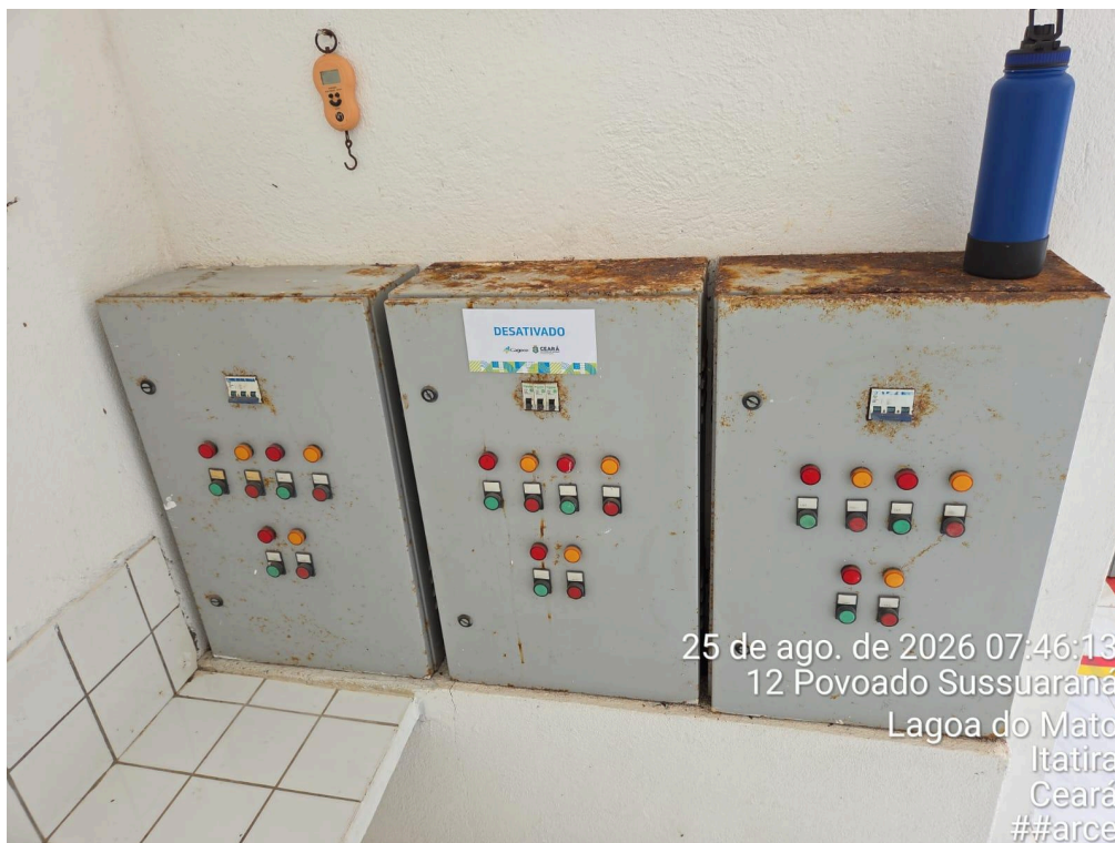
Foto 17 - Casa de química (ETA - Lagoa do Mato ): quadros elétricos desativados, mantidos na área operacional e necessitando de desmobilização.
