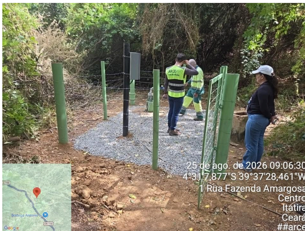
Foto 42 - PT-17 (Sede): ausência de identificação da unidade.
