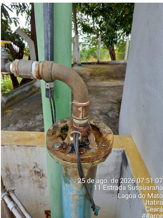
Foto 10 - RSE-01 (ETA - Lagoa do Mato ): tubulação e conexões com sinais de corrosão, presença de incrustações e indícios de vazamento, além de fiação elétrica exposta e disposta de forma inadequada.
