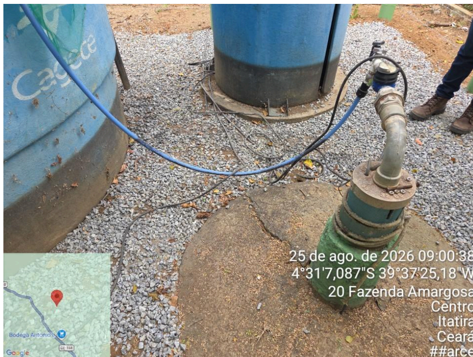
Foto 38 - PT-14 (Sede): mangueira e fiação elétrica expostas, dispostas de forma desorganizada diretamente sobre o solo, em área destinada à circulação e ao acesso operacional.
