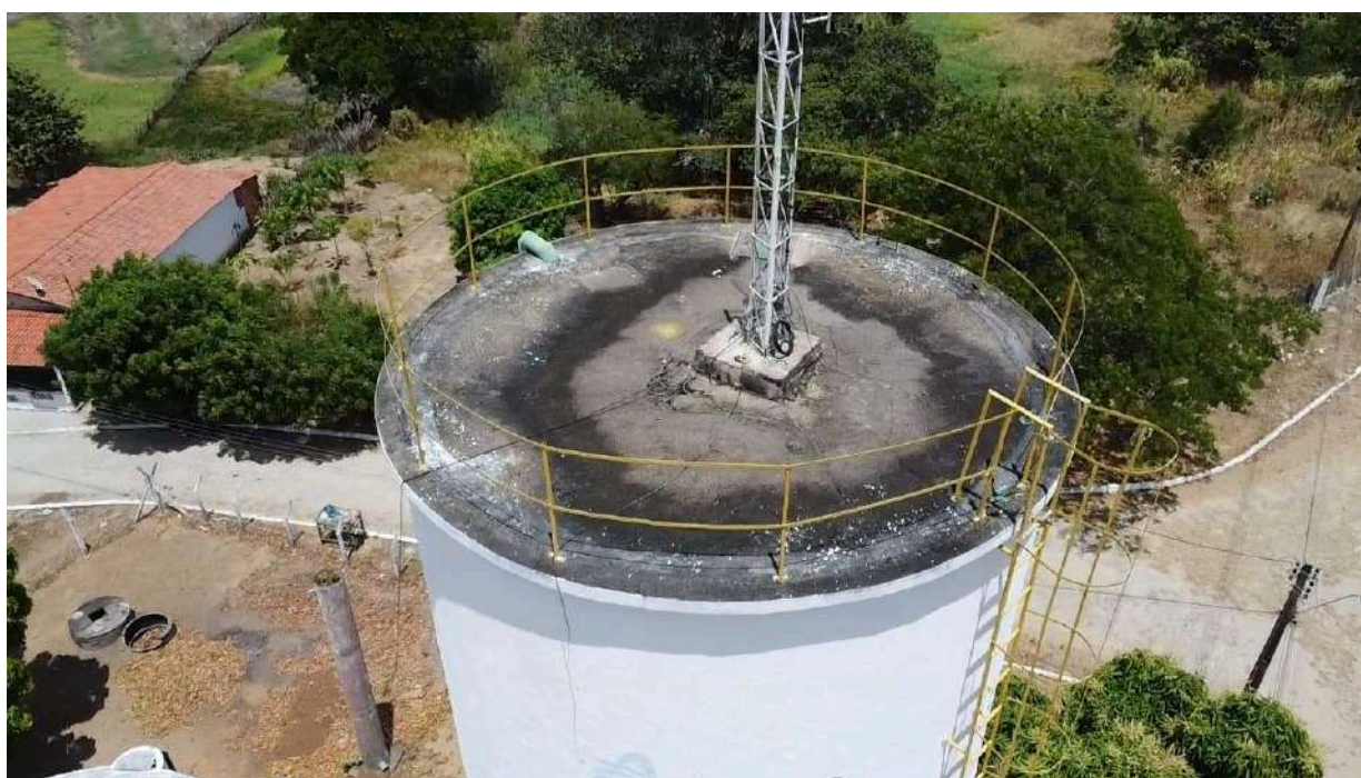
Foto 35 - REL-01 (Brotas): deterioração do revestimento da cobertura e presença de cabos dispostos de forma desorganizada sobre a superfície.
