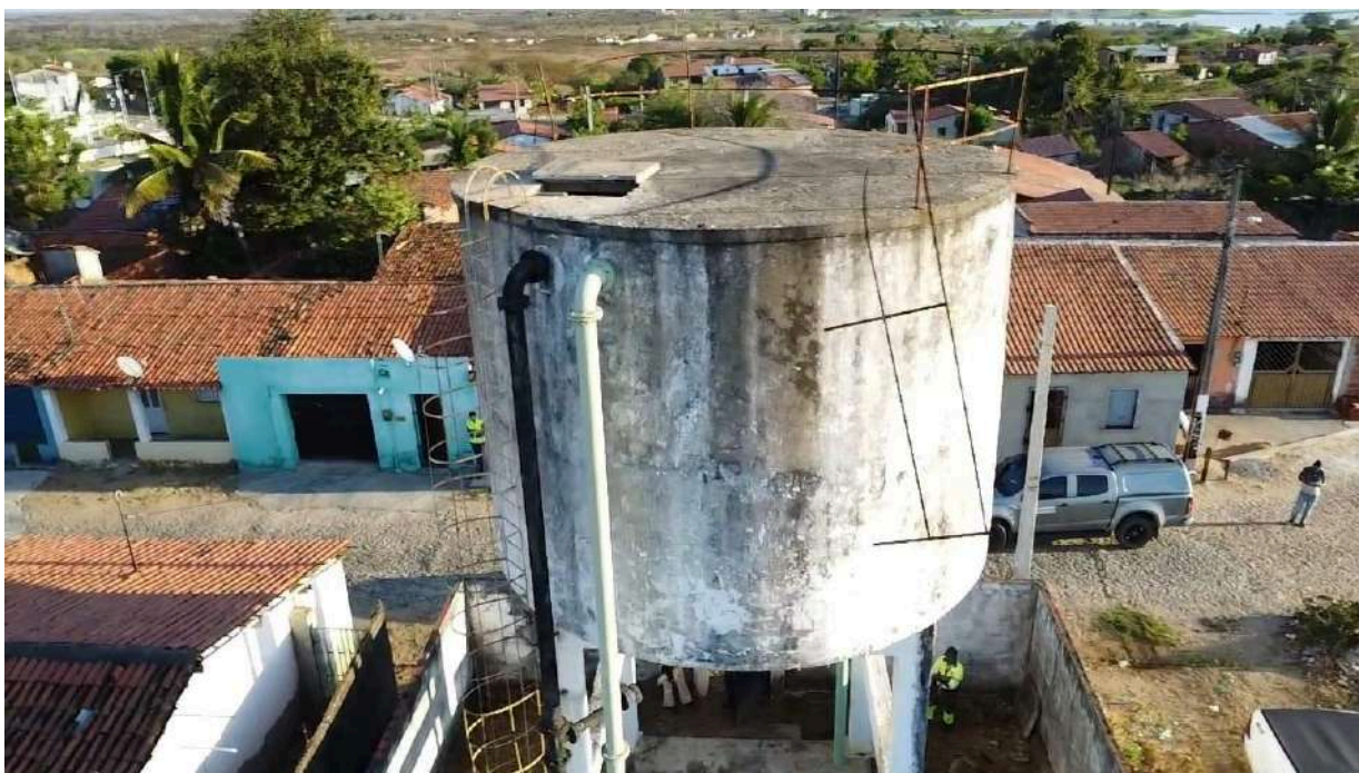
Foto 7 - REL-01 (Sede): sinais de umidade e deterioração do revestimento externo, além de tubulação com sinais de oxidação e guarda-corpo metálico deformado e com sinais de corrosão.
