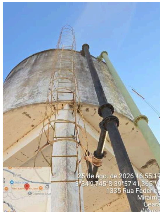
Foto 12 - REL-01 (Sede): estrutura metálica da escada e tubulação com corrosão, além de deterioração do concreto do reservatório, com desprendimento do revestimento e exposição das armaduras.
