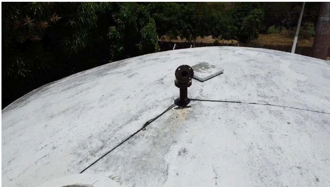
Foto 28 - RAP-02 (Brotas): deterioração do revestimento da cobertura, além de suspiro sem proteção adequada e com sinais de corrosão.
