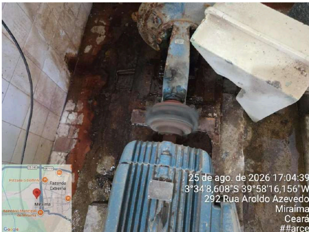
Foto 14 - EEAT-01 (Sede): conjunto motobomba com proteção do acoplamento deslocada e inadequadamente fixada, presença de sujidades e acúmulo de água na área adjacente, sinais de corrosão em componentes metálicos.
