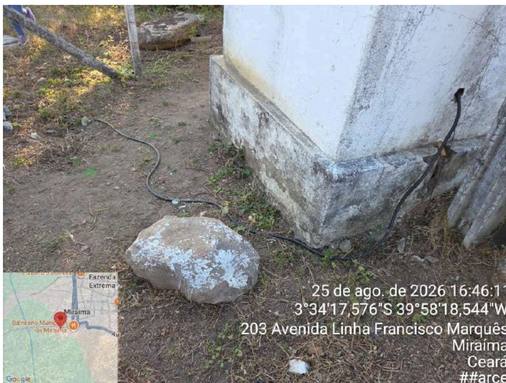
Foto 4 - Casa de comando (captação) ( Sede ): fiação exposta e disposta diretamente sobre o solo, sem proteção por eletroduto, com passagem inadequada pela abertura na parede da unidade.
