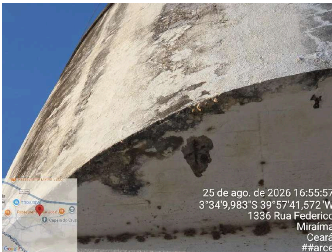
Foto 8 - REL-01 (Sede): presença de vazamentos e deterioração no revestimento externo, com exposição das armaduras.
