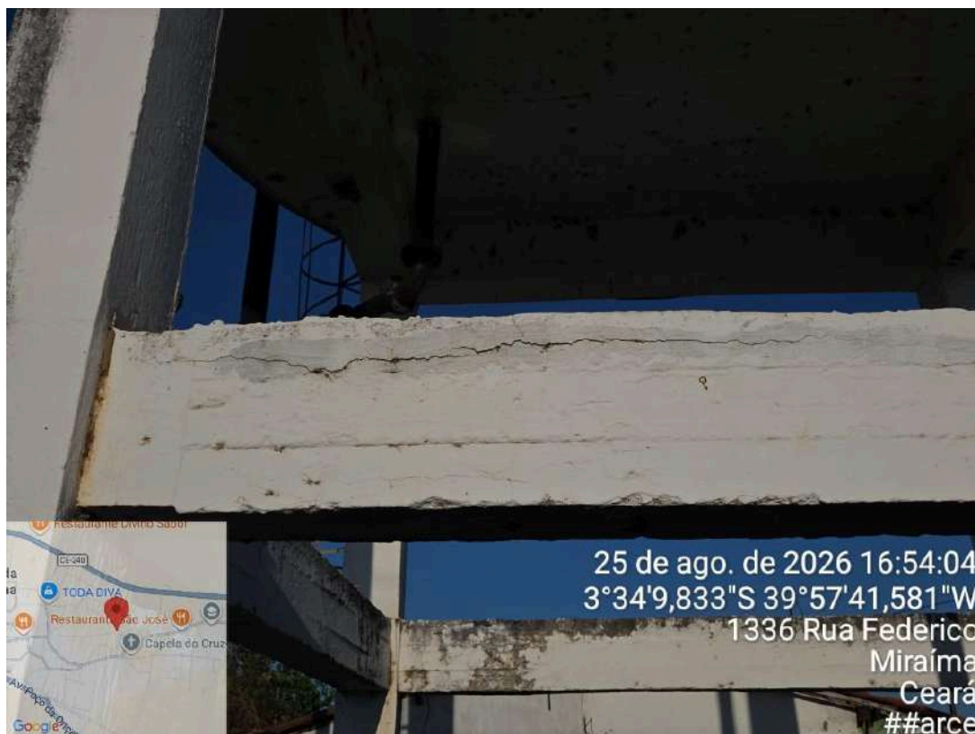
Foto 10 - REL-01( Sede ): viga de concreto com fissura longitudinal e sinais de deterioração superficial.
