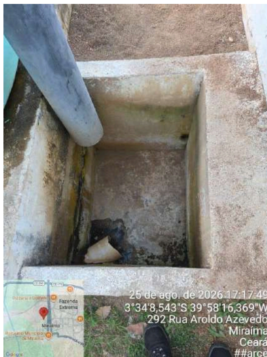
Foto 18 - Filtro de fibra (F-03 ( Sede )): caixa de drenagem/descarga aberta, sem tampa ou grade de proteção.
