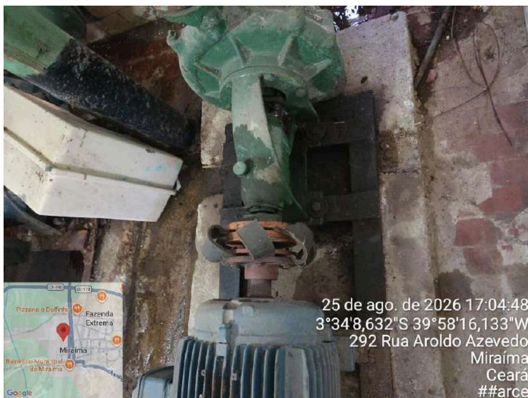
Foto 15 - EEAT-01 (Sede): conjunto motobomba com acoplamento exposto e desprovido de proteção, presença de sujidades e acúmulo de água na área adjacente, sinais de corrosão nos componentes metálicos e deterioração da estrutura de apoio.
