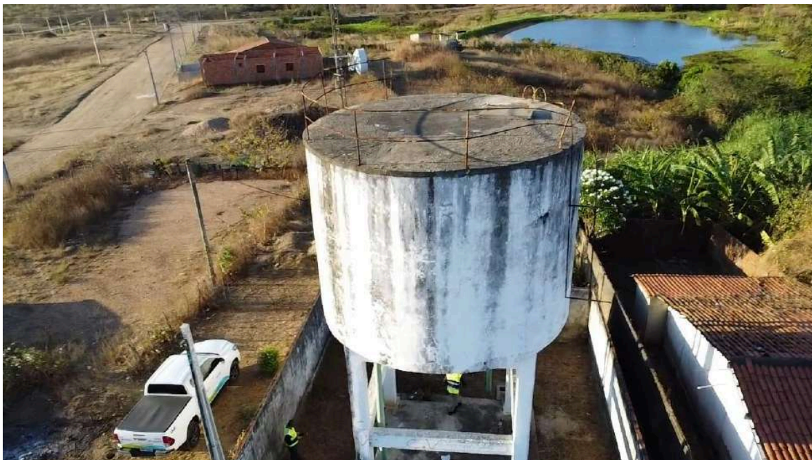
Foto 5 - REL-01 (Sede): guarda-corpo metálico apresentando sinais acentuados de corrosão e deformação, além de deterioração e manchas no revestimento externo da estrutura.
