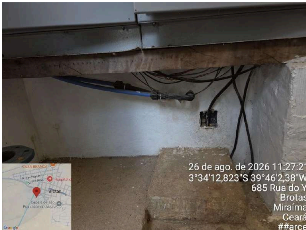
Foto 38 - Casa de bombas ( Brotas ): fiação elétrica exposta e desorganizada, com cabos soltos dispostos sob os quadros de comando, além de caixa elétrica sem proteção adequada.
