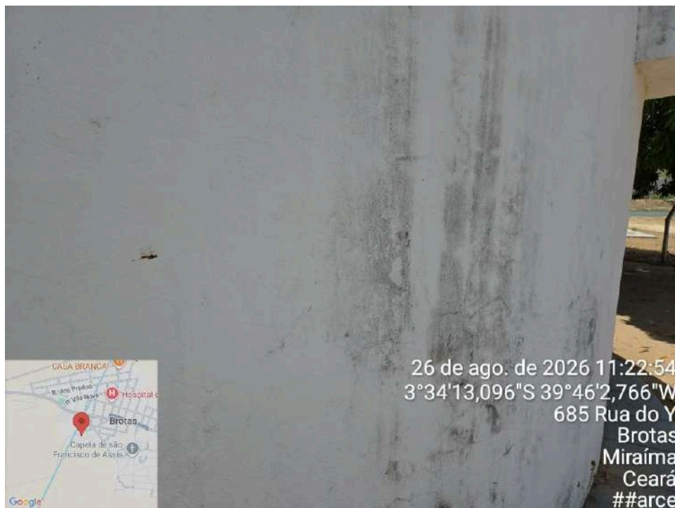
Foto 32 - RAP-02 ( Brotas ): fissura no revestimento da parede, associada a sinais de umidade/infiltração e manchas de deterioração.
