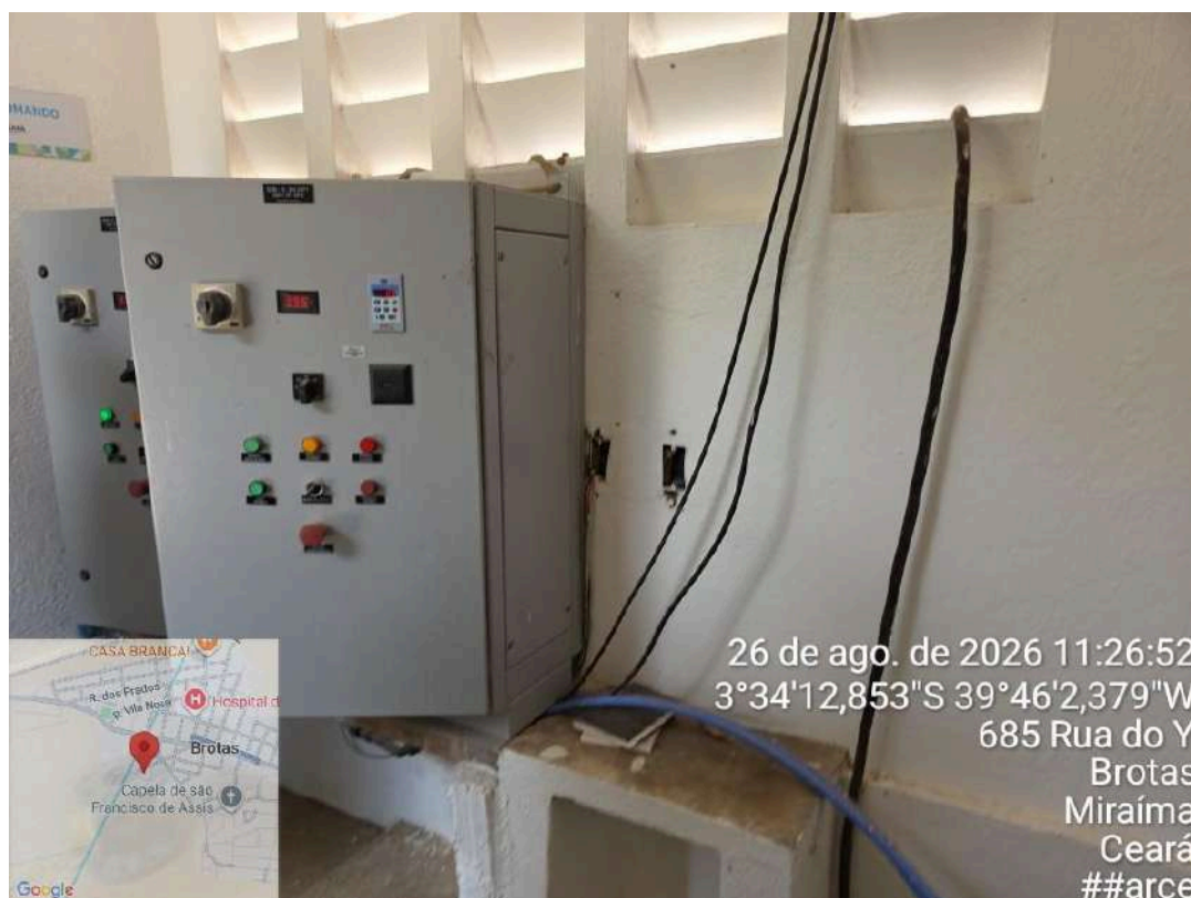
Foto 39 - Casa de bombas ( Brotas ): quadro de comando com fiação exposta e desorganizada, cabos soltos dispostos ao longo da parede e da bancada, caixas elétricas sem proteção adequada, além da presença de sujidades.
