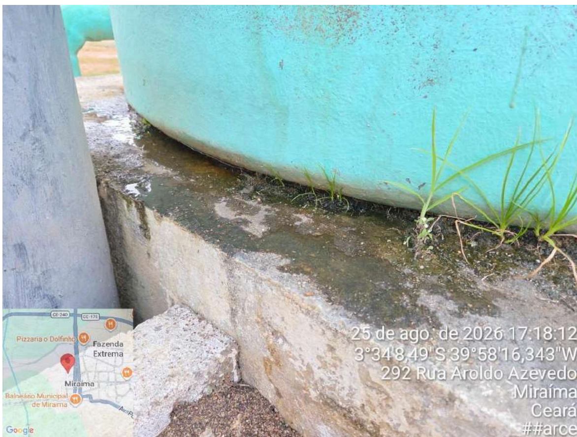
Foto 19 - Filtro de fibra (F-03) ( Sede ): presença de vazamentos.
