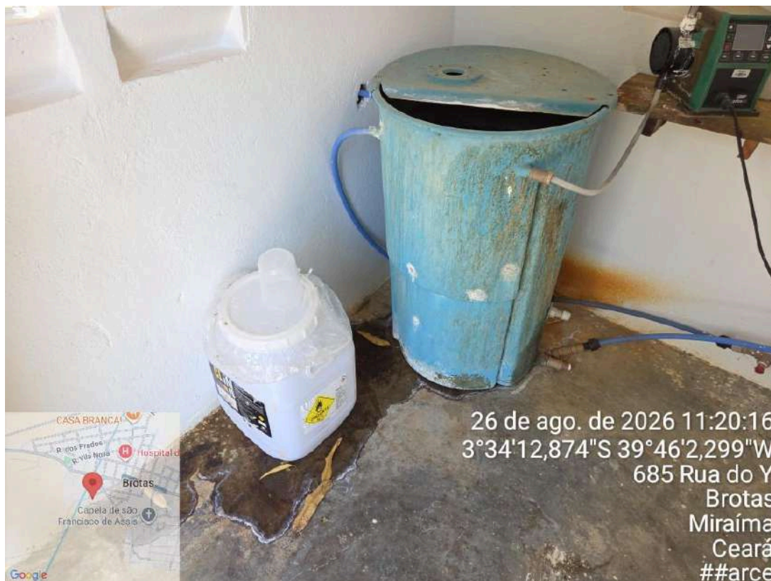
Foto 26 - Casa de química (Brotas): recipiente do sistema de dosagem de cloro com tampa deformada e fechamento inadequado, apresentando sinais de deterioração, além de presença de vazamentos e resíduos no piso adjacente.
