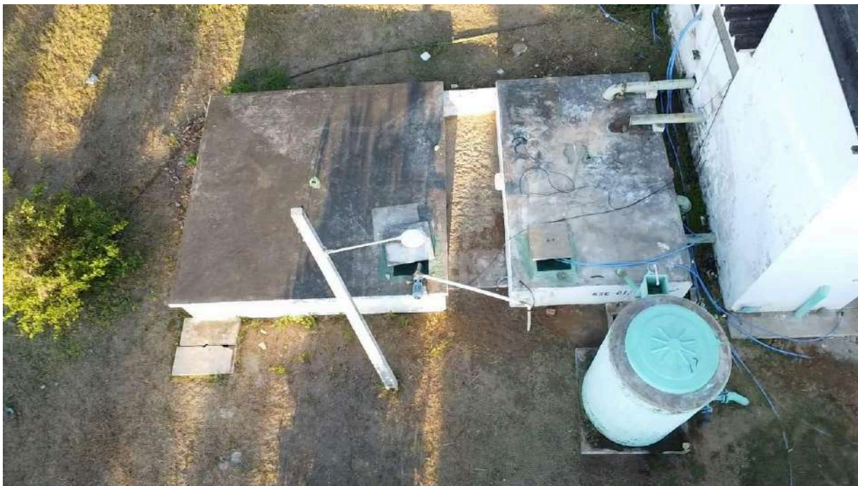
Foto 20 - RSE-01 e RSE-02 ( Sede ): aberturas superiores destampadas e sem fechamento adequado, além de mangueiras e cabos dispostos de forma desorganizada sobre as coberturas e na área operacional.
