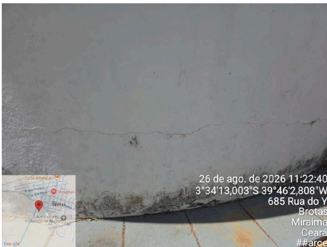
Foto 31 - RAP-02 ( Brotas ): fissura no revestimento da parede, associada a sinais de umidade/infiltração e manchas de deterioração na região inferior da estrutura.
