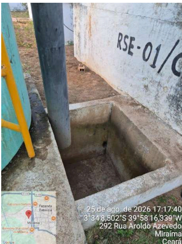
Foto 21 - RSE-01 ( Sede ): caixa de drenagem/descarga aberta, sem tampa ou grade de proteção.
