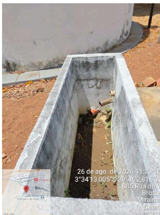
Foto 33 - RAP-02 ( Brotas ): caixa de drenagem/descarga aberta, sem tampa ou grade de proteção.
