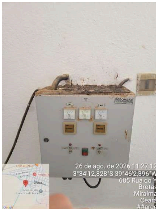
Foto 40 - Casa de bombas ( Brotas ): quadro de comando com acúmulo de sujeidades e resíduos sobre a parte superior, além de sinais de corrosão em componentes e pontos da estrutura metálica.
