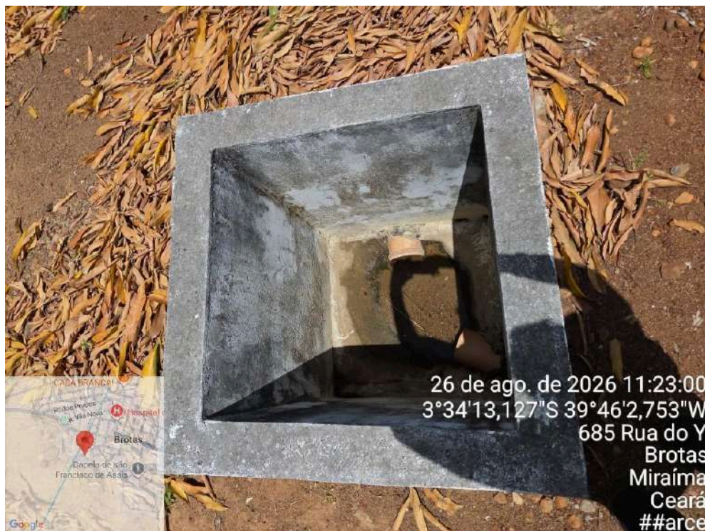
Foto 34 - RAP-02 (Brotas): caixa de drenagem/descarga aberta, sem tampa ou grade de proteção.
