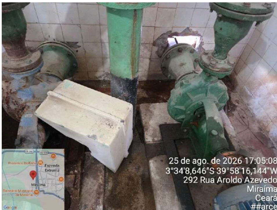
Foto 16 - EEAT-01 (Sede): conjunto motobomba com proteção do acoplamento deslocada e inadequadamente fixada, presença de sujidades e acúmulo de água na área adjacente, sinais de corrosão em componentes metálicos e abertura sem vedação adequada no ponto de passagem da tubulação pela parede.
