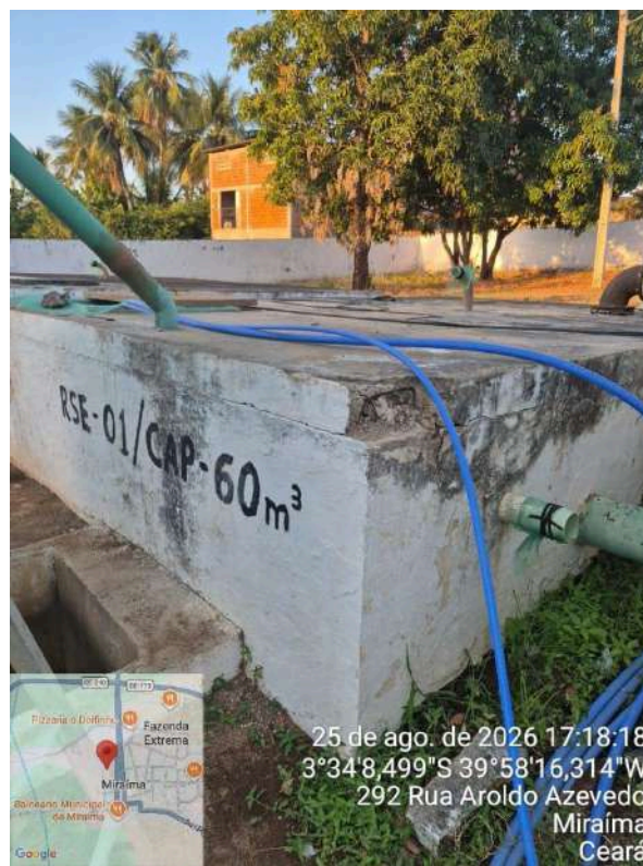
Foto 22 - RSE-01 ( Sede ): estrutura de concreto com deterioração do revestimento, desprendimento do concreto e exposição da armadura, além de sinais de umidade e presença de vegetação junto à base.
