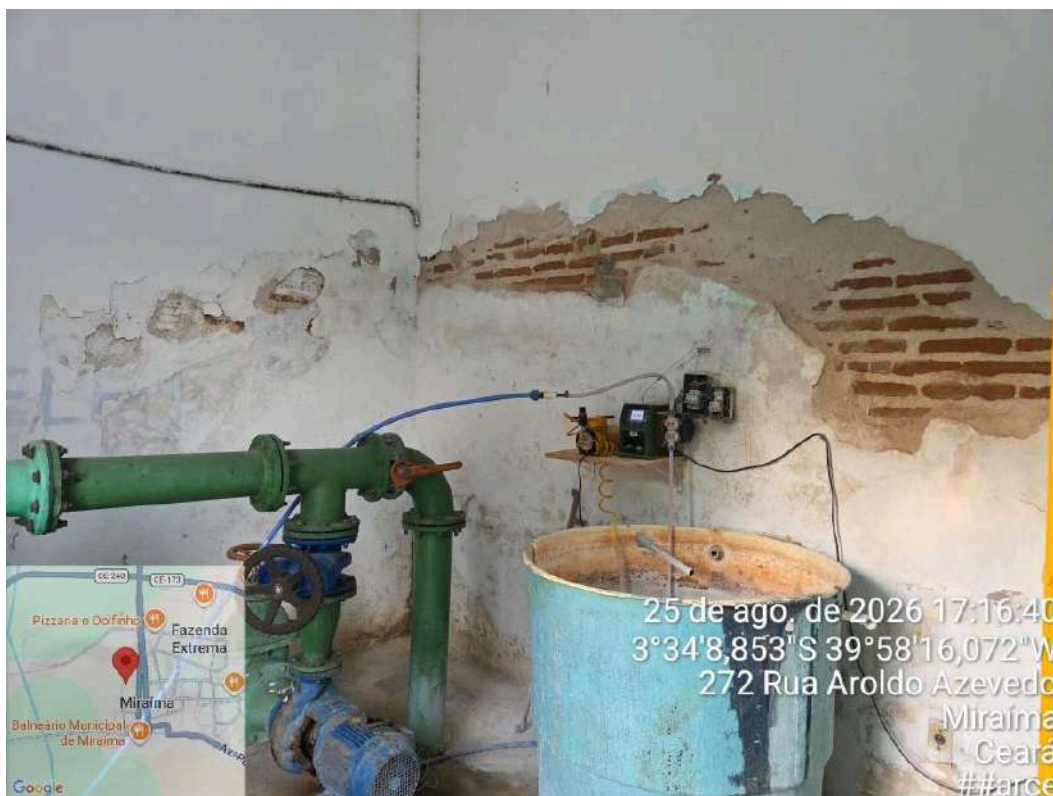
Foto 17 - EELF-01 (Sede): parede com revestimento deteriorado e desprendimento do reboco, com exposição da alvenaria, sinais de corrosão em componentes metálicos, além de fiação elétrica e mangueiras aparentes e dispostas de forma desorganizada junto aos equipamentos.
