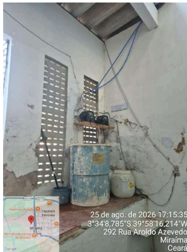
Foto 24 - Casa de química (Sede): fiação exposta e desorganizada, mangueiras dispostas de forma inadequada, recipientes e equipamentos armazenados sem organização, além de paredes com deterioração do revestimento, fissuras e sinais de umidade.
