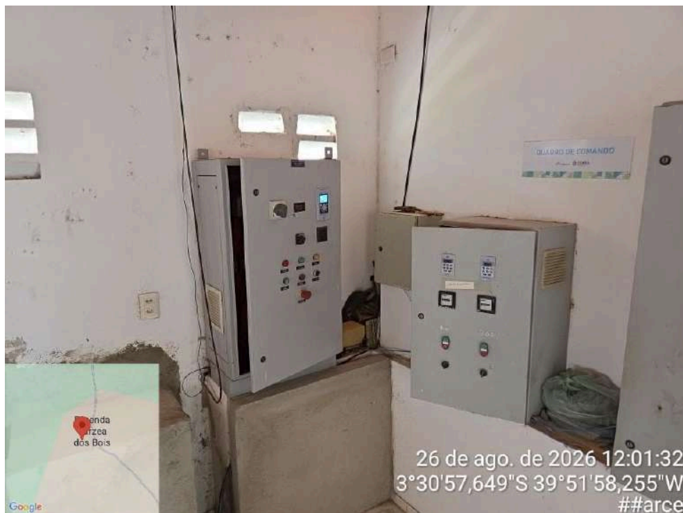
Foto 36 - EEAT (Brotas): quadros de comando com portas parcialmente abertas, fiação aparente e desorganizada, além de presença de materiais armazenados inadequadamente na área operacional e sinais de deterioração nas paredes.
