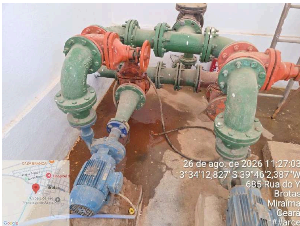
Foto 41 - Casa de bombas ( Brotas ): fiação exposta e desorganizada, conjuntos motobomba, registros e conexões com sinais de corrosão, além de presença de vazamento, acúmulo de água e sujeidades no piso da área operacional.
