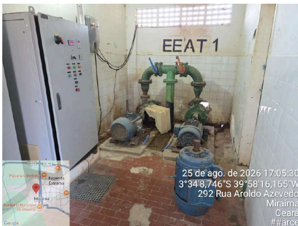
Foto 13 - EEAT-01 (Sede): conjuntos motobomba com sinais de deterioração, componentes/equipamentos dispostos inadequadamente no piso, fiação do quadro elétrico exposta e desorganizada, além de sujidades e de acúmulo de água na área operacional.
