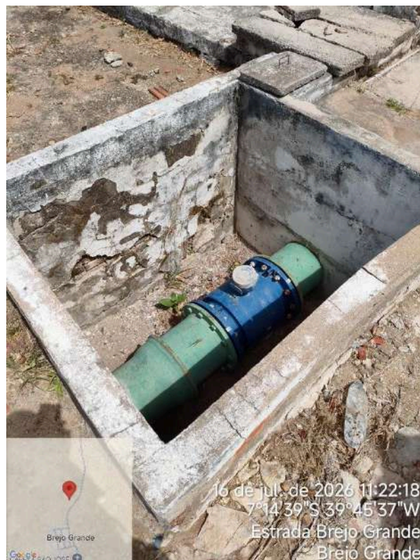
Foto 14 - ETA (Brejo Grande): caixa sem tampa.
