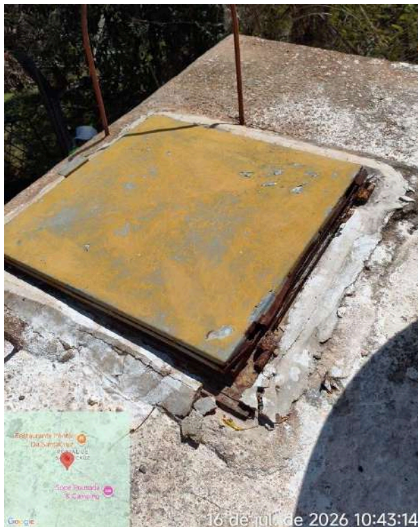
Foto 95 - RAP-03 (Brejo Grande): tampa oxidada e danificada.
