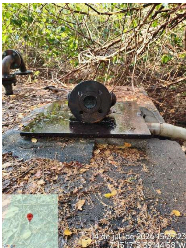
Foto 93 - RAP-02 (Brejo Grande): tampa oxidada e com fechamento inadequado com peça.
