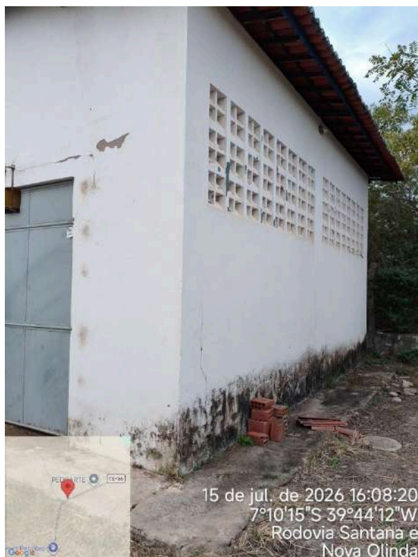
Foto 73 - EEAT-02 (Sítio Mororó): teto e parede interna e externa desgastados.
