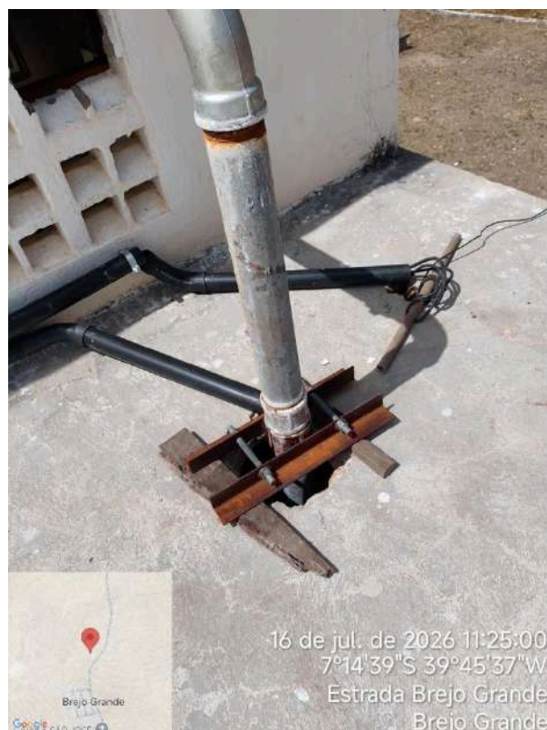
Foto 16 - ETA / RAP-04 (Brejo Grande): abertura na laje vulnerável à contaminação.
