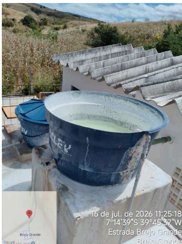
Foto 19 - ETA / Cloração (Brejo Grande): caixa de cloração sem tampa.
