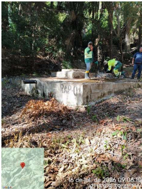
Foto 47 - RAP-01 (Sede): pintura e identificação desgastadas.
