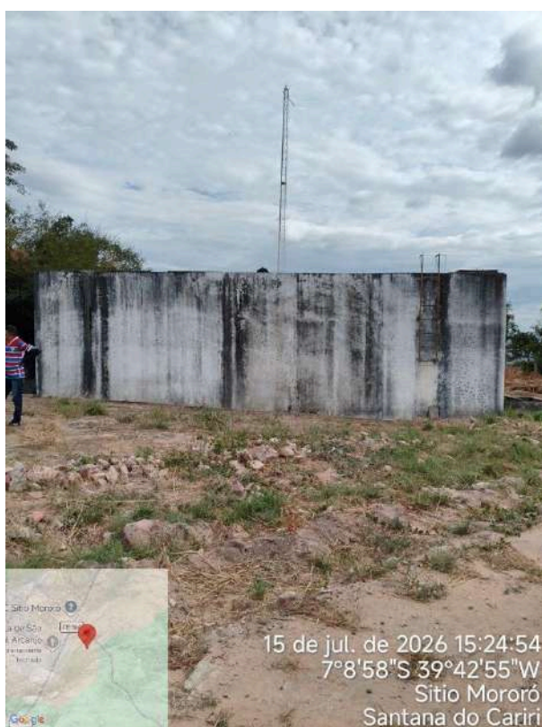
Foto 27 - RAP-05 (Sítio Mororó): sem identificação; sem grade de proteção na laje e identificação no reservatório.
