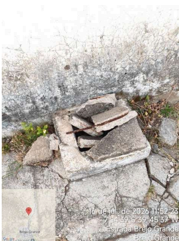
Foto 61 - ETA / Pátio ( Brejo Grande ): caixa danificada.
