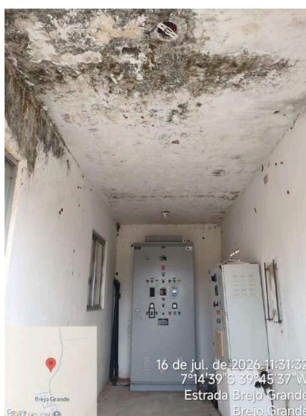
Foto 62 - ETA / EEAT-01 ( Brejo Grande ): paredes deterioradas; lâmpada queimada ou ausente.
