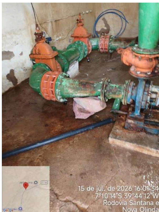
Foto 77 - EEAT-02 (Sítio Mororó): bomba com vazamento.
