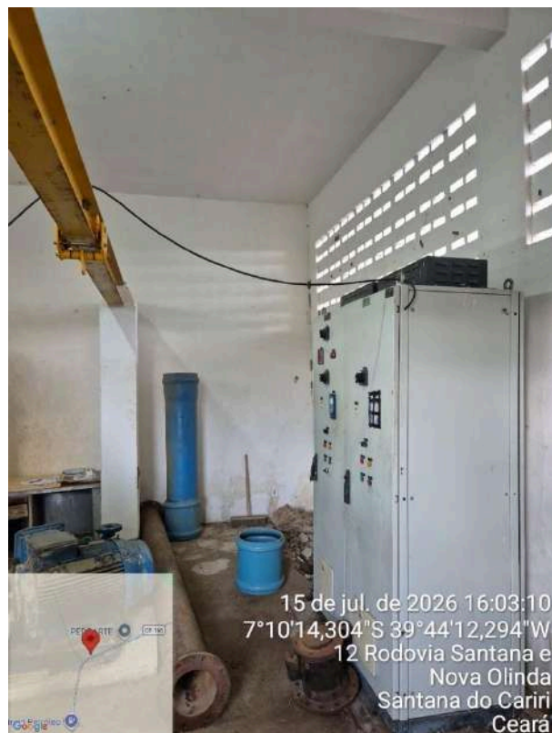
Foto 34 - EEAT-02 (Sítio Mororó): fiação sem eletrodutos.
