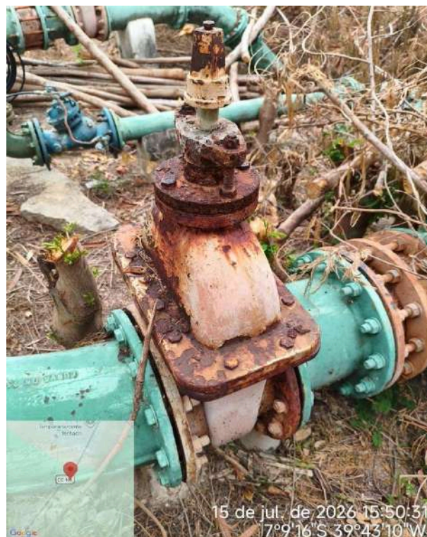
Foto 72 - TAU (Sítio Mororó): registro em processo de corrosão/oxidação.
