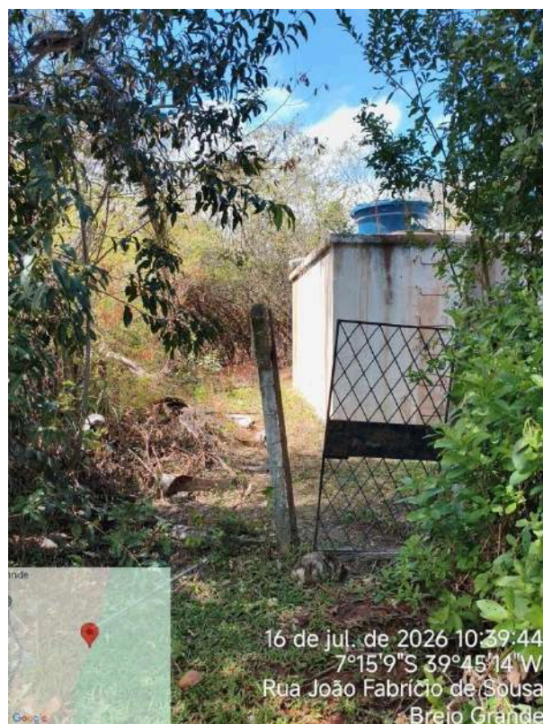
Foto 94 - RAP-03 (Brejo Grande): cerca e portão danificados.
