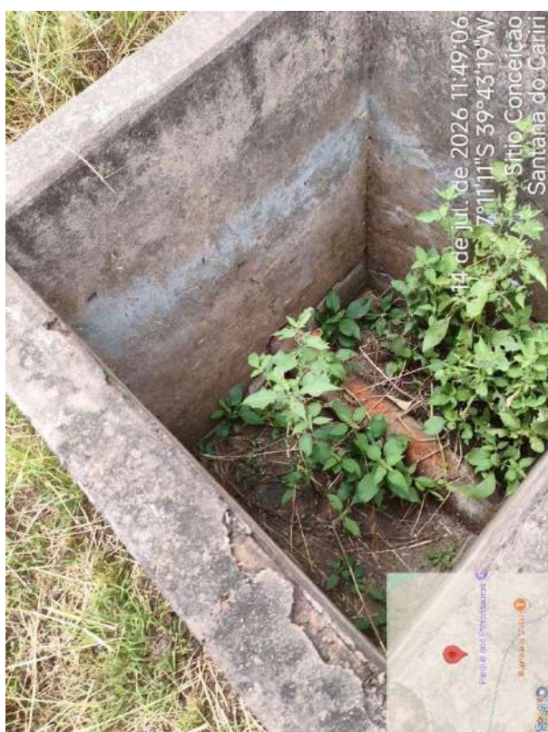
Foto 7 - ETA / Pátio (Sede): caixa de proteção e inspeção desprovidas de tampa na área do pátio.
