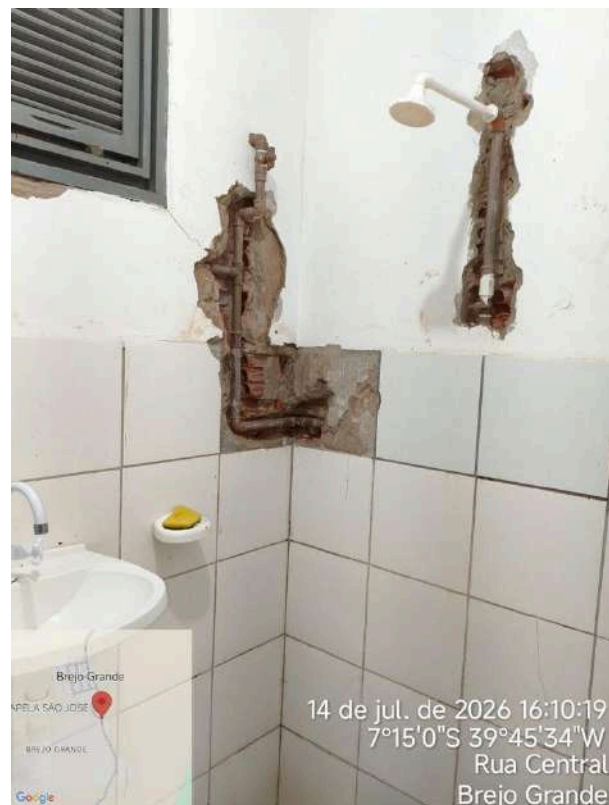
Foto 38 - Núcleo (Brejo Grande): banheiro sem acabamento.
