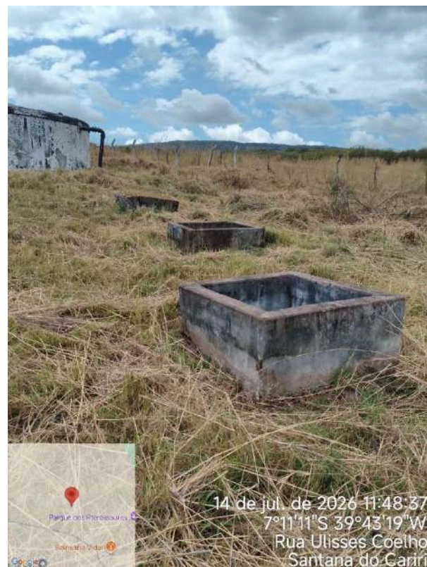
Foto 6 - ETA / Pátio (Sede): caixas de proteção e inspeção desprovidas de tampas na área do pátio.
