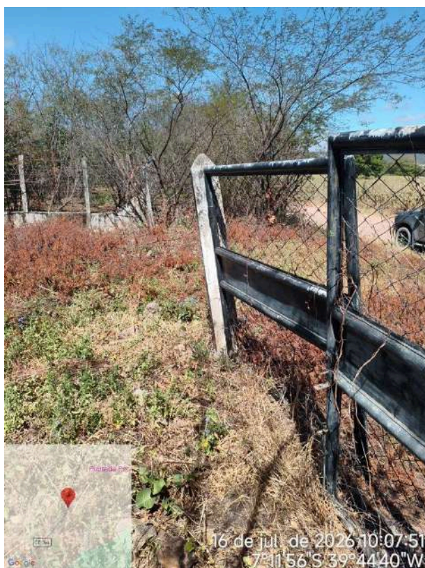
Foto 57 - TAU (Brejo Grande): portão e cerca danificados; crescimento de vegetação.
