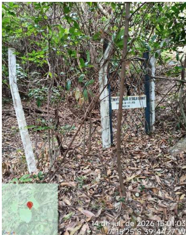
Foto 87 - FT-02/FT-03 (Brejo Grande): cerca de proteção e isolamento perimetral danificada.
