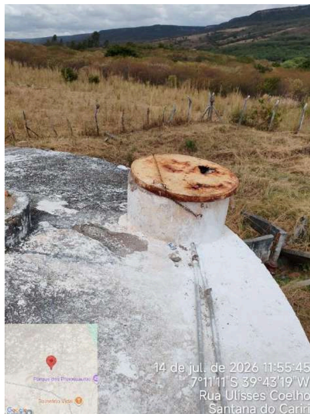
Foto 56 - ETA / RAP-02 (Sede): tampa em processo de corrosão.
