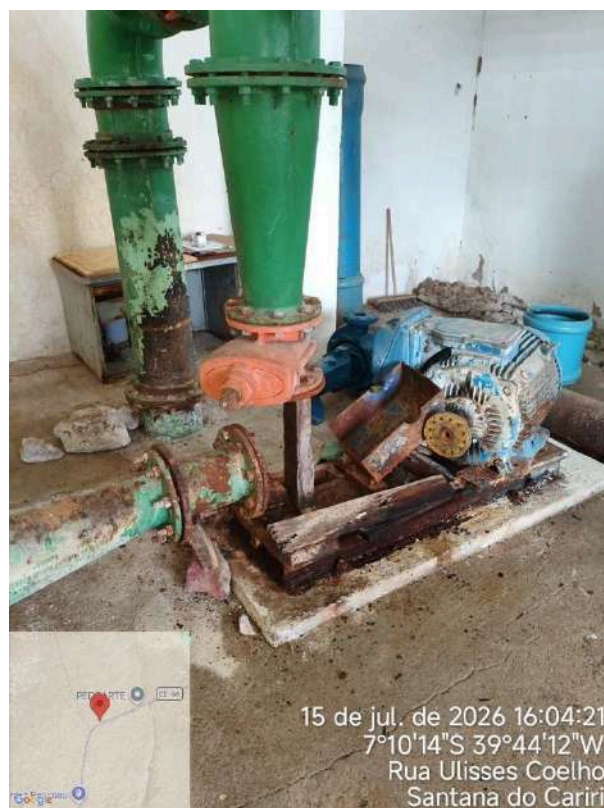
Foto 32 - EEAT-02 (Sítio Mororó): sem bomba reserva instalada.
