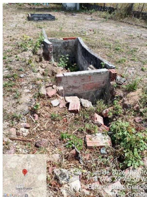
Foto 12 - ETA (Brejo Grande): caixa sem tampa e inacabada.
