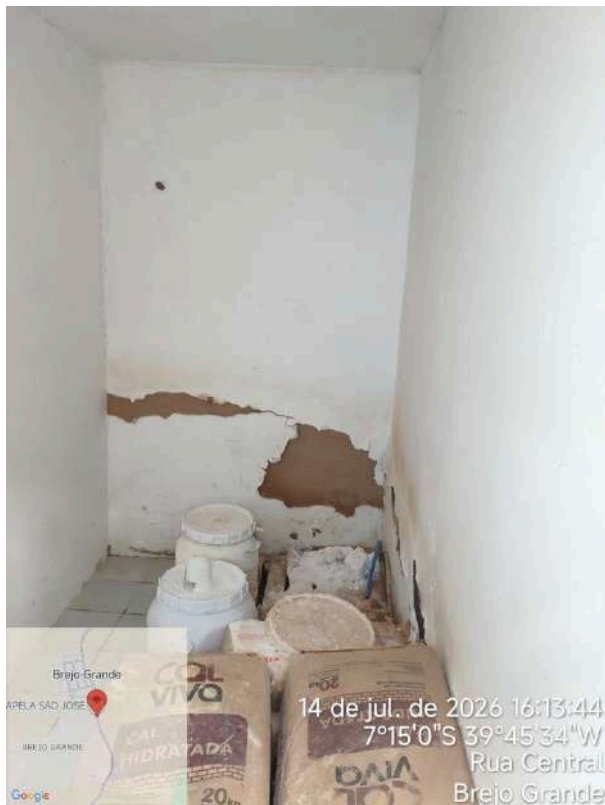
Foto 83 - Núcleo (Brejo Grande): depósito de produtos químicos com paredes deterioradas.
