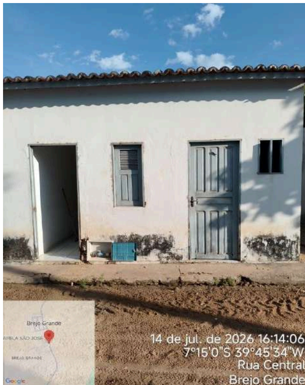
Foto 79 - Núcleo (Brejo Grande): reboco e pintura externa e interna deteriorados.
