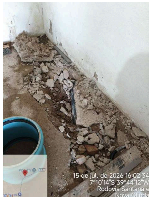
Foto 76 - EEAT-02 (Sítio Mororó): piso danificado.
