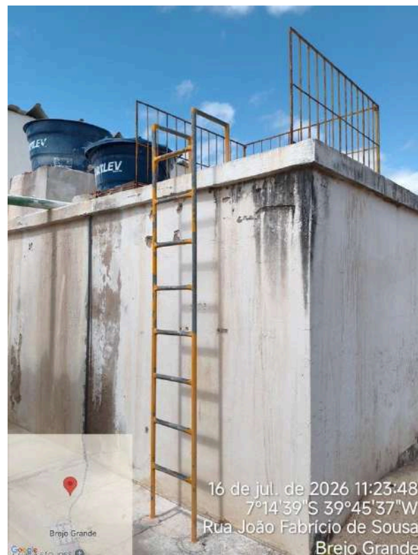
Foto 18 - ETA / RAP-04 (Brejo Grande): escada sem guarda-corpo.
