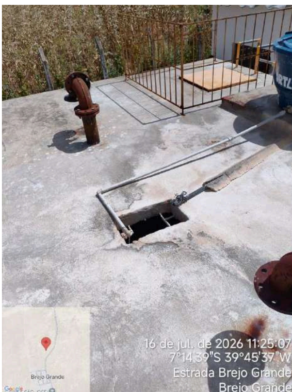
Foto 15 - ETA / RAP-04 (Brejo Grande): abertura na laje vulnerável à contaminação; tubulação sem tela de proteção.
