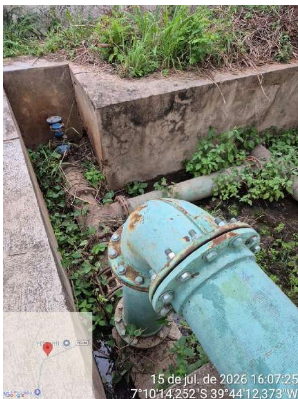
Foto 35 - EEAT-02 (Sítio Mororó): caixa de passagem sem grade de proteção.
