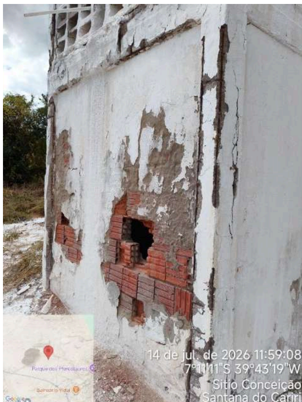
Foto 53 - ETA / Casa de Química ( Sede ): infraestrutura com anomalias e patologias estruturais.
