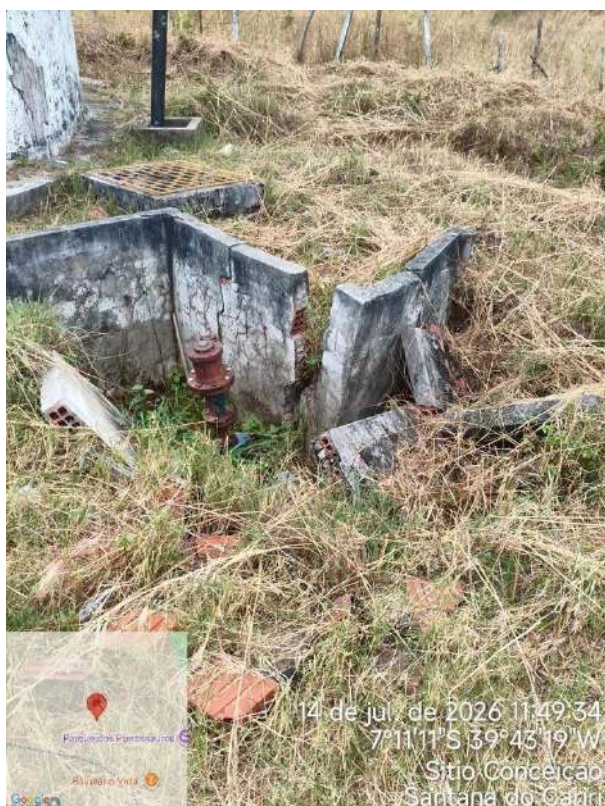
Foto 49 - ETA / Pátio (Sede): caixa de proteção danificada na área do pátio, vegetação crescida.
