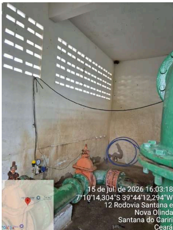
Foto 33 - EEAT-02 (Sítio Mororó): fiação sem eletrodutos.
