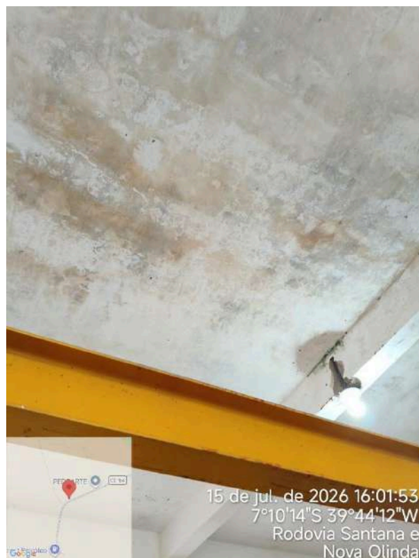
Foto 74 - EEAT-02 (Sítio Mororó): teto e parede interna e externa desgastados
