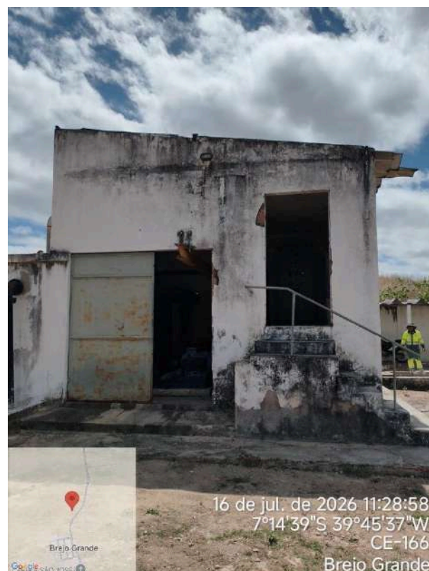
Foto 20 - ETA / EEAT-01 (Brejo Grande): sem identificação.
