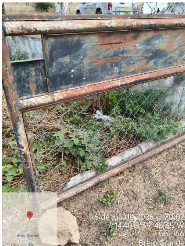
Foto 59 - ETA / Pátio ( Brejo Grande ): portão danificado e oxidado.
