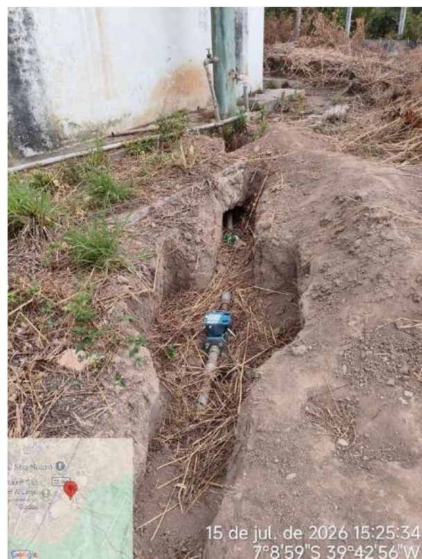
Foto 70 - RAP-05 ( Sítio Mororó ): caixa de inacabada e vala aberta com erosão.
