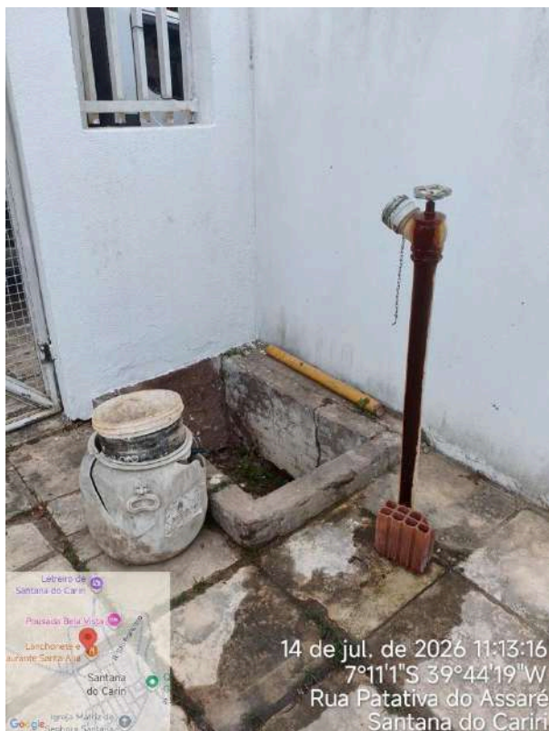
Foto 5 - Núcleo (Sede): abastecimento do Carro-Pipa com caixa sem tampa.
