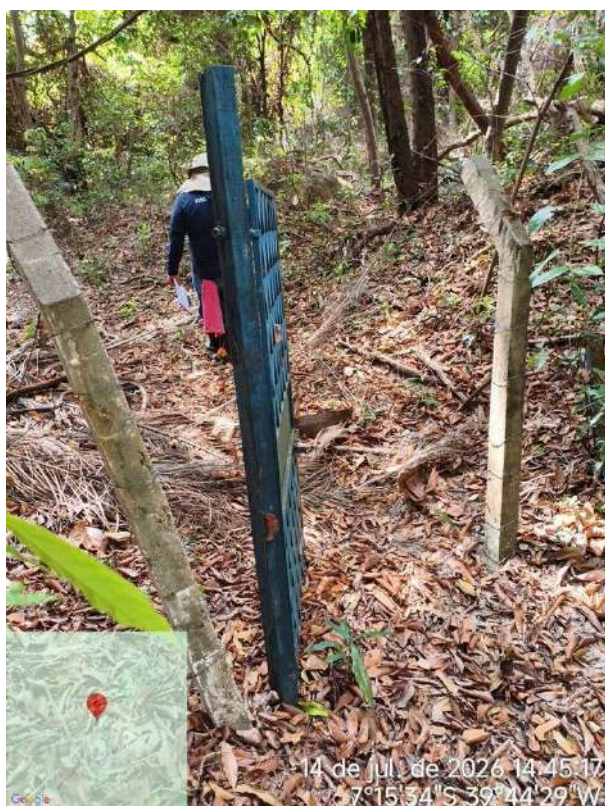
Foto 85 - FT-01 (Brejo Grande): cerca de proteção e isolamento perimetral danificada.
