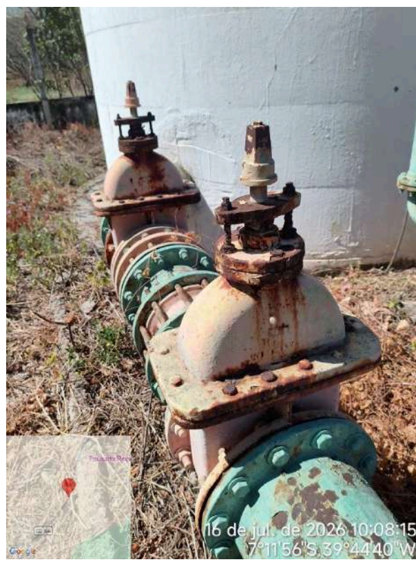
Foto 58 - TAU (Brejo Grande): registros em processo avançado de corrosão/oxidação.
