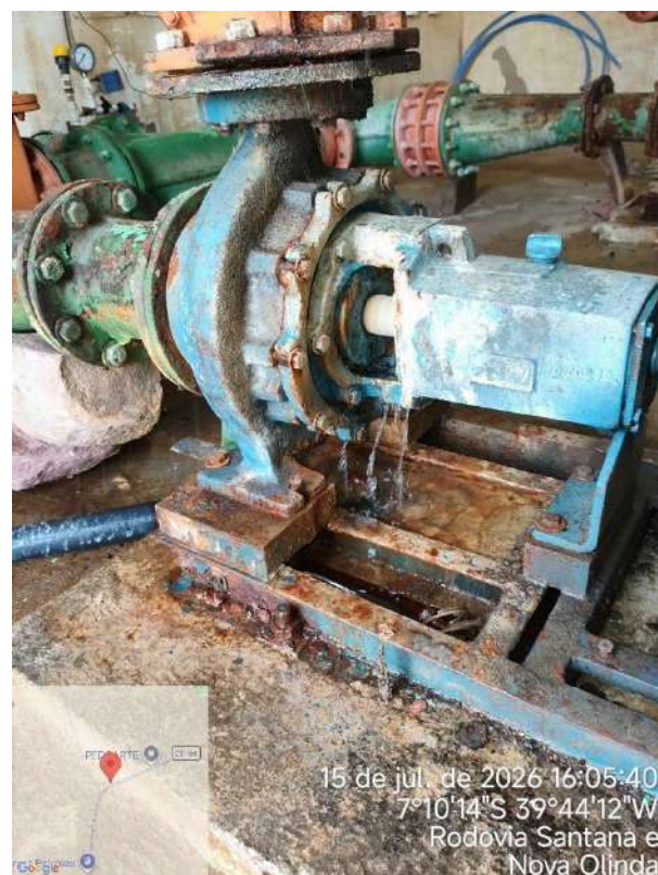
Foto 78 - EEAT-02 (Sítio Mororó): bomba com vazamento.
