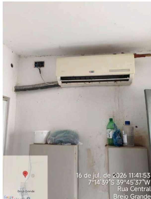
Foto 68 - ETA / Casa Operador ( Brejo Grande ): ar condicionado com defeito.
