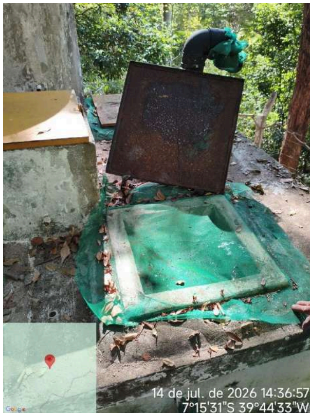
Foto 91 - RAP-01 (Brejo Grande): tampa oxidada e danificada.
