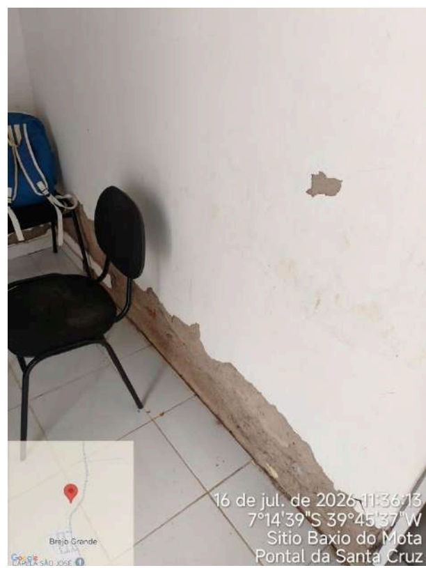
Foto 66 - ETA / Casa Operador (Brejo Grande): paredes deterioradas.
