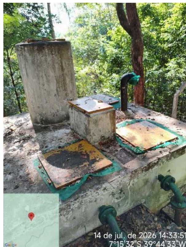
Foto 90 - RAP-01 (Brejo Grande): identificação e pintura deterioradas.
