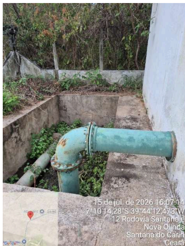
Foto 36 - EEAT-02 (Sítio Mororó): caixa de passagem sem grade de proteção.
