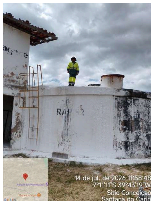
Foto 8 - ETA / RAP-02 (Sede): ausência de grade de proteção na plataforma superior / laje de cobertura.
