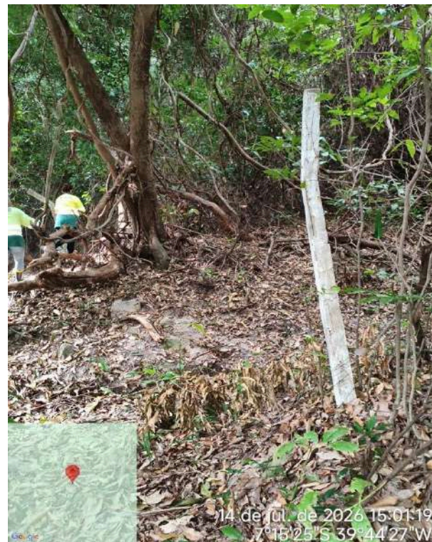
Foto 88 - FT-02/FT-03 (Brejo Grande): cerca de proteção e isolamento perimetral danificada.
