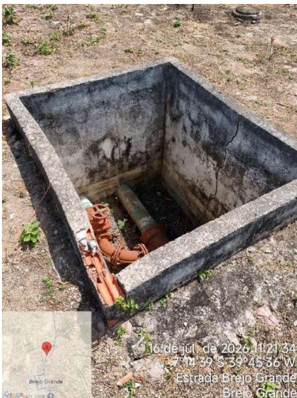
Foto 13 - ETA (Brejo Grande): caixa sem tampa.
