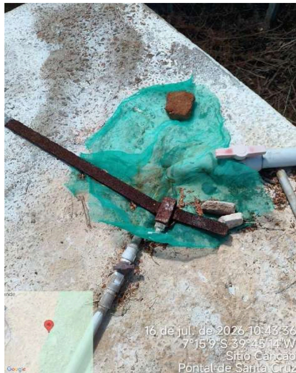
Foto 96 - RAP-03 (Brejo Grande): peças oxidadas segurando a tela de proteção.
