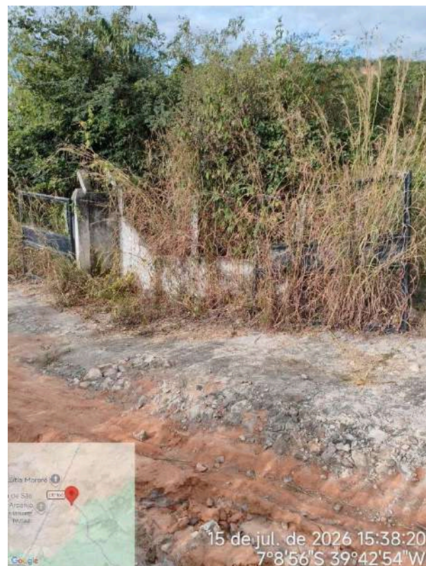
Foto 26 - RAP-05 (Sítio Mororó): sem identificação; portão com instalação incompleta.
