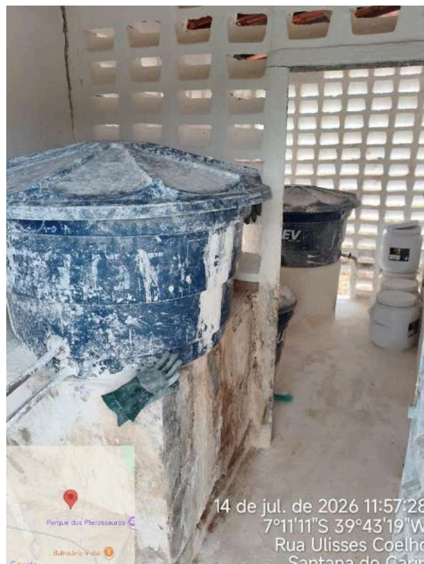
Foto 54 - ETA / Casa de Química ( Sede ): infraestrutura com anomalias e patologias estruturais.
