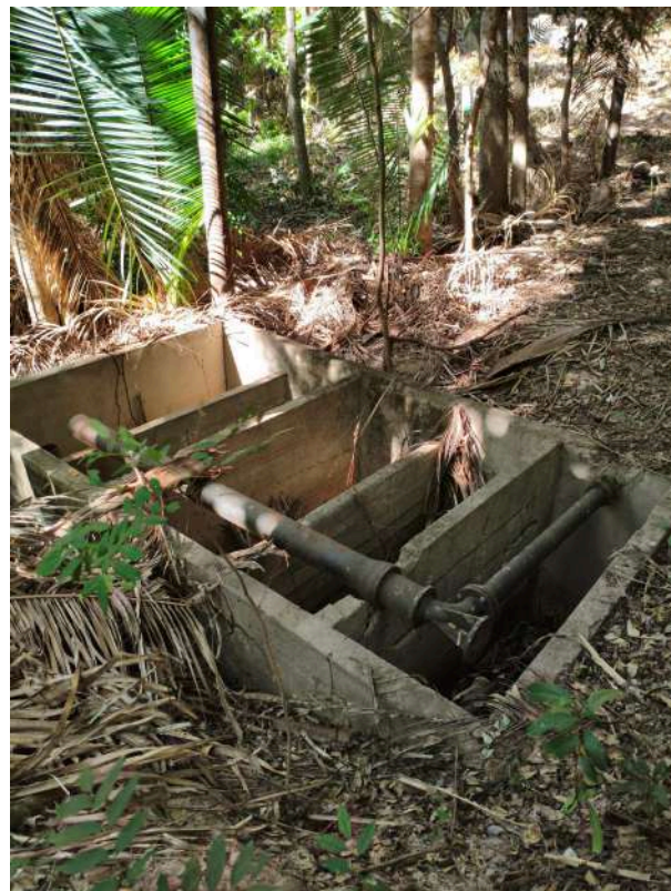
Foto 48 - Tanque desativado (Sede): tanque desativado próximo ao portão de acesso à área de captação, sem tampa ou isolamento de proteção.
