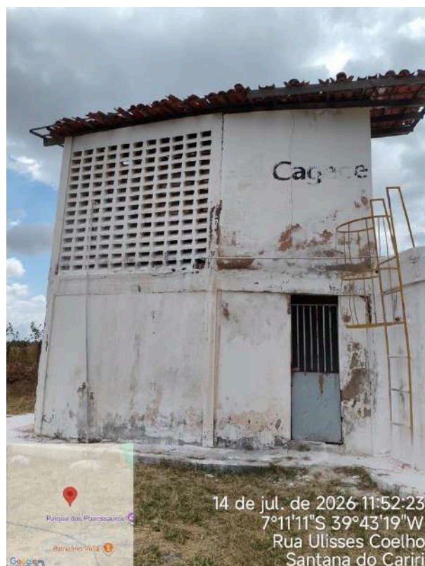
Foto 50 - ETA / Casa de Química (Sede): pintura e identificação deterioradas.
