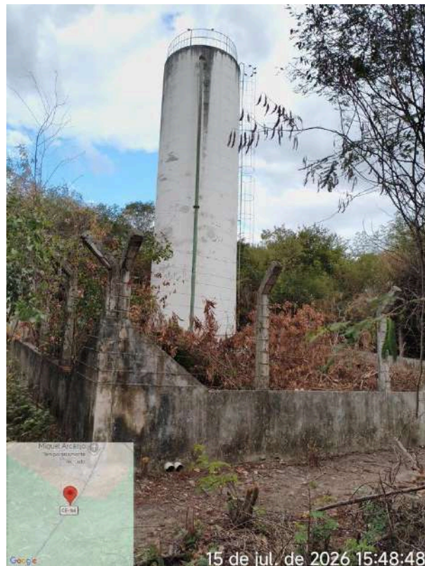
Foto 30 - TAU (Sítio Mororó): sem para-raios e identificação.
