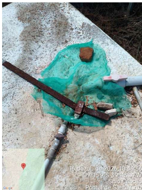
Foto 44 - RAP-03 (Brejo Grande): abertura de entrada de tubulação vulnerável à contaminação.
