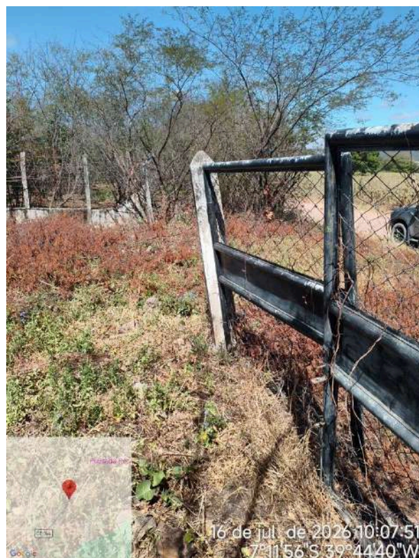
Foto 98 - TAU (Brejo Grande): cerca e portão danificados.
