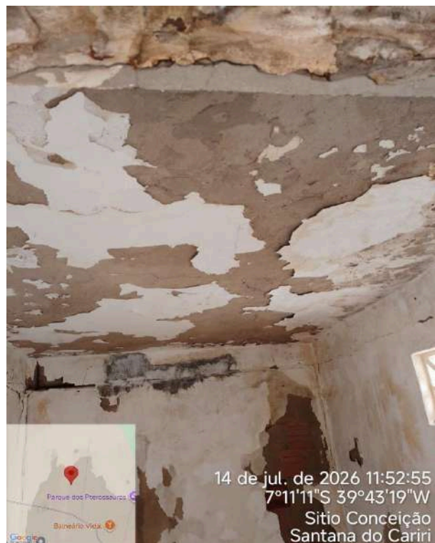
Foto 52 - ETA / Casa de Química ( Sede ): infraestrutura com anomalias e patologias estruturais.
