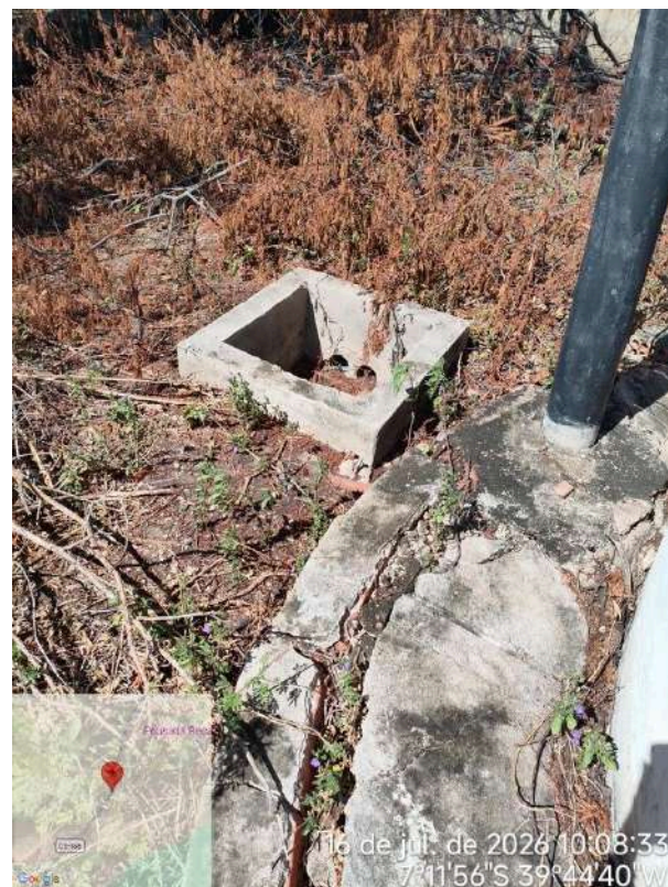
Foto 10 - TAU (Brejo Grande): caixa sem tampa.
