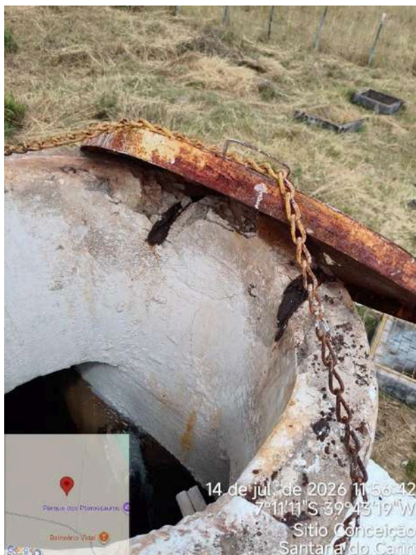
Foto 55 - ETA / RAP-02 (Sede): abertura deteriorada.
