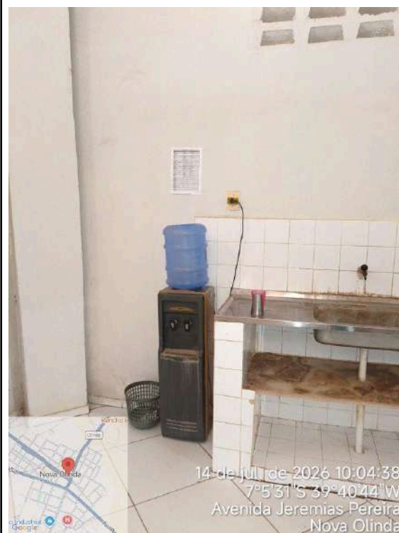
Foto 2 - Escritório operacional (Sede): bebedouro não instalado em local acessível aos usuários.
