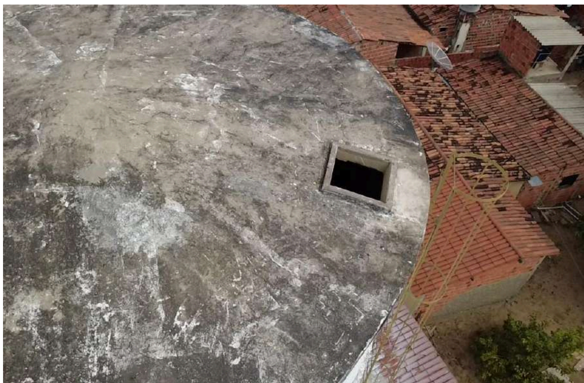
Foto 39 - ETA / REL-01 (Triunfo): ausência de tampa.
