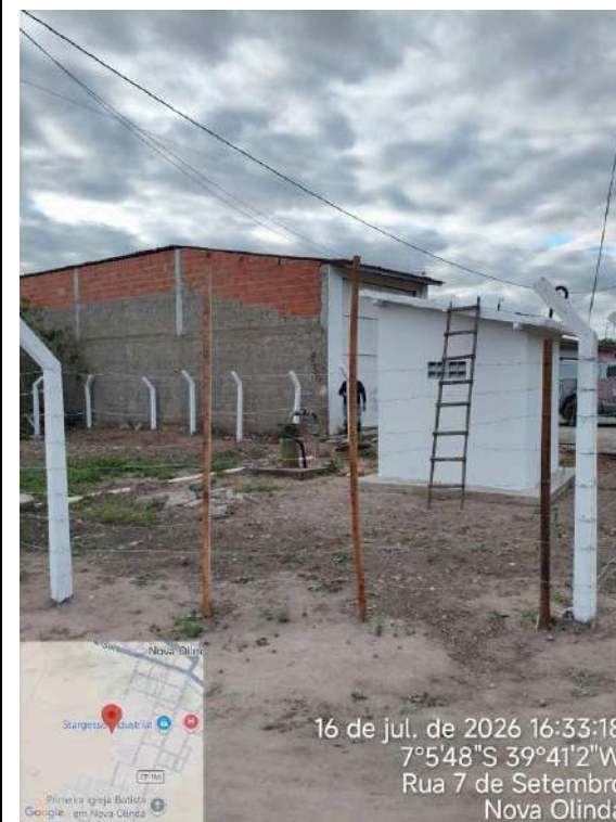
Foto 28 - PT-07 (Sede): poço sem identificação; abertura de acesso é precária e rústica do tipo "colchete".
