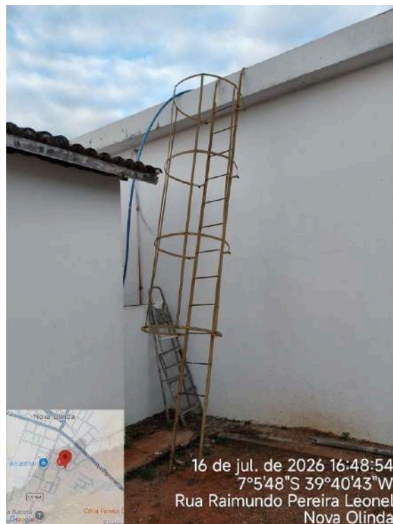
Foto 32 - ETA / RAP-01 (Sede): escada de acesso inadequada e ausência de grade de proteção no patamar superior / laje de cobertura.
