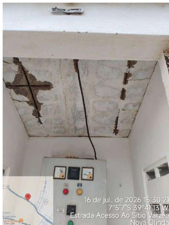
Foto 57 - PT-08 (Sede): laje da casa do quadro de comando com rachaduras e armaduras expostas.
