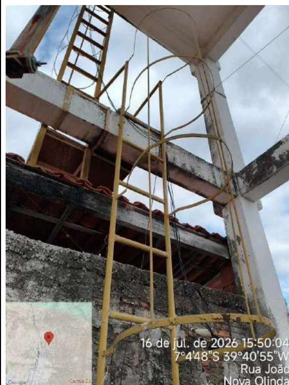
Foto 24 - REL-03 (Sede): fiação conduzida junto da estrutura metálica da escada de acesso, sem eletrodutos de proteção e isolamento.
