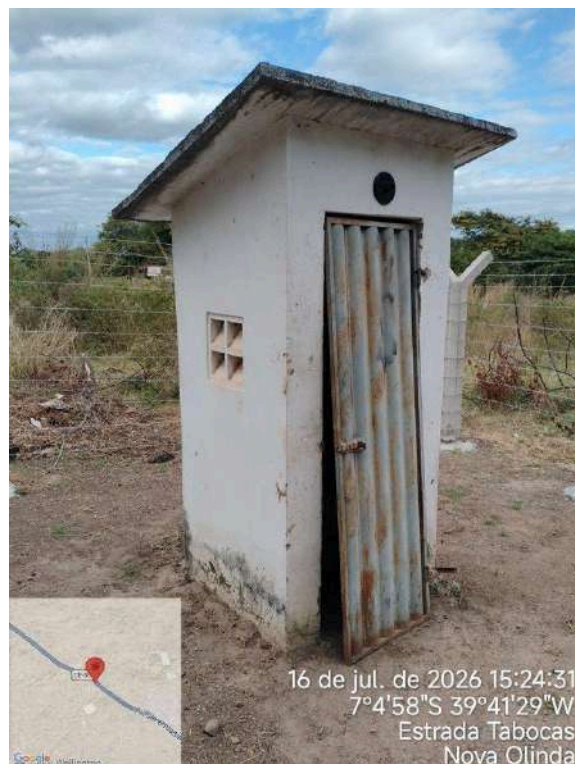
Foto 55 - PT-12 (Sede): portão da casa do quadro de comando danificado.
