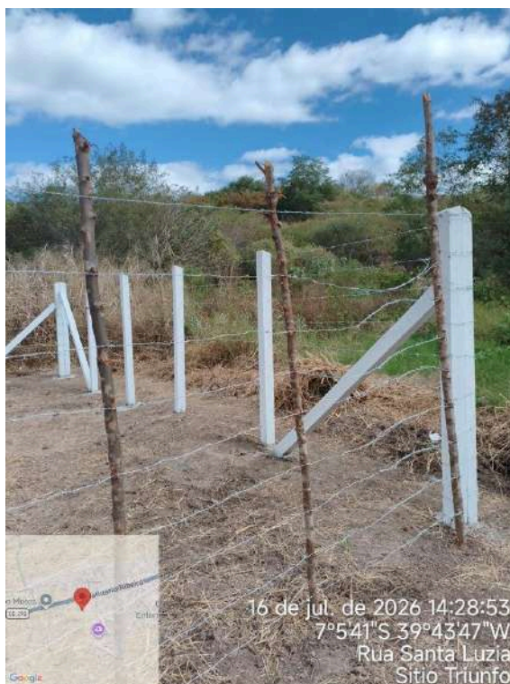
Foto 35 - PT-02 ( Triunfo ): vão de acesso com fechamento precário.
