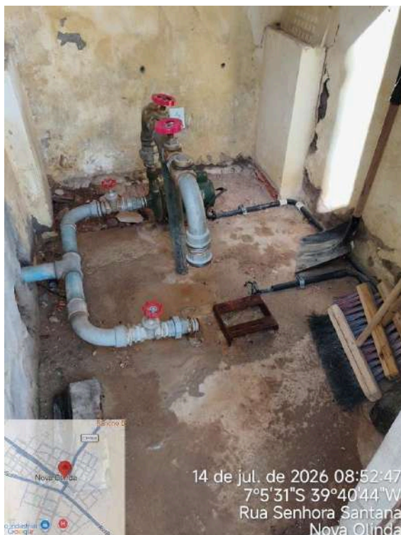
Foto 5 - RAP-03 / EEAT-03 (Sede): ausência de bomba reserva; piso e parede deteriorados; piso molhado e com sujeira; materiais e equipamentos armazenados na casa de bombas.
