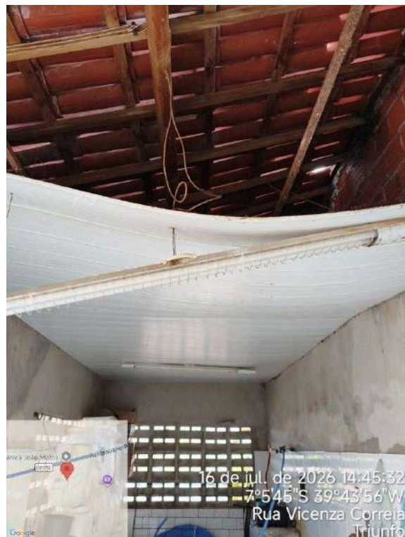
Foto 76 - ETA / Casa de Química_Almojarifado (Triunfo): teto em desmoronamento; lâmpadas queimadas.
