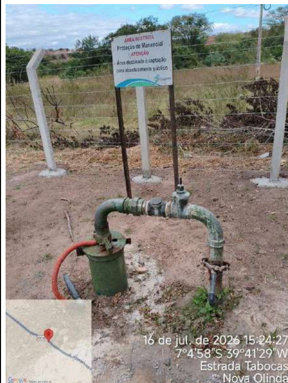
Foto 14 - PT-12 (Sede): poço desprovido de laje de proteção.
