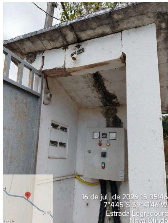
Foto 51 - PT-10 (Sede): casa do quadro de comando com anomalias estruturais; ausência de lâmpadas.
