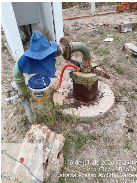
Foto 56 - PT-08 (Sede): tubo do poço em processo de corrosão / oxidação.
