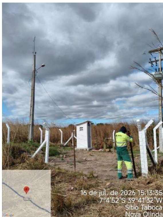
Foto 11 - PT-09 (Sede): portão de acesso precário; ausência de identificação.
