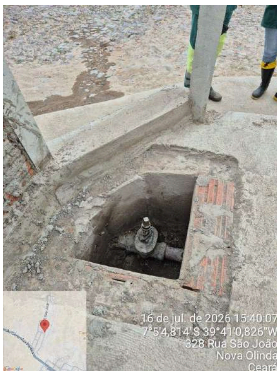
Foto 19 - RAP-02 / EEAT-02 ( Sede ): caixas de proteção e inspeção desprovidas de tampas.
