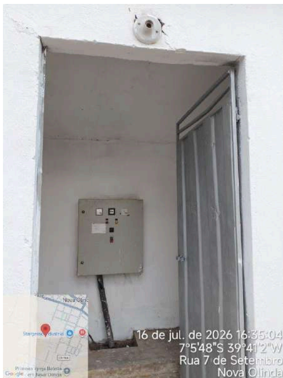
Foto 66 - PT-07 ( Sede ): falta de lâmpada externa.
