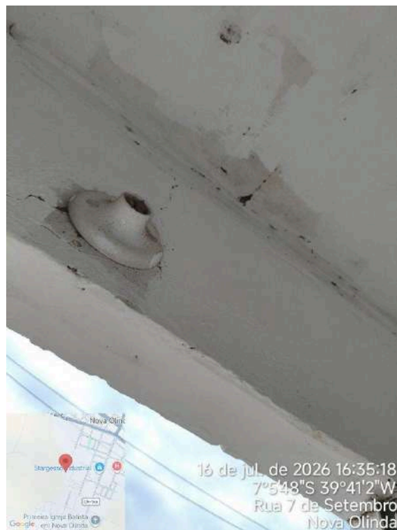
Foto 67 - PT-07 ( Sede ): falta de lâmpada interna.
