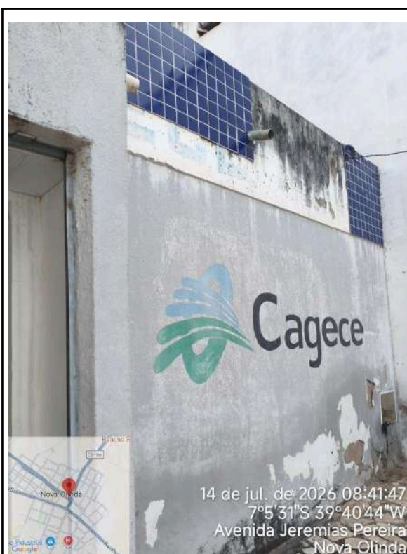
Foto 44 - Escritório Operacional / Loja de Atendimento ( Sede ): revestimento e pintura externos deteriorados.
