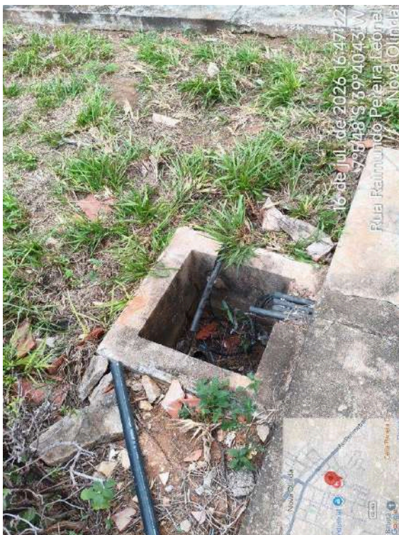
Foto 31 - ETA / Pátio (Sede): caixa desprovida de tampa.
