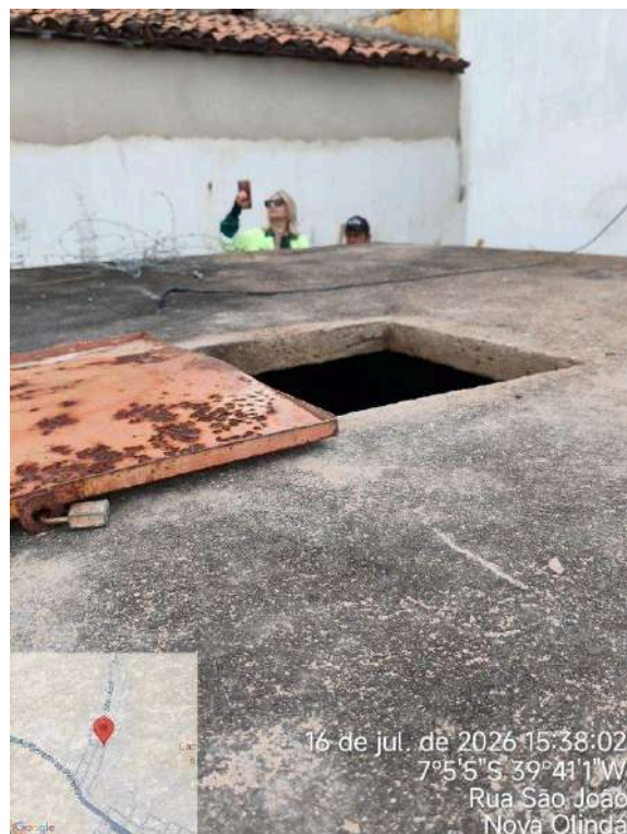
Foto 59 - RAP-02 / EEAT-02 (Sede): abertura de inspeção com tampa em processo de corrosão / oxidação.
