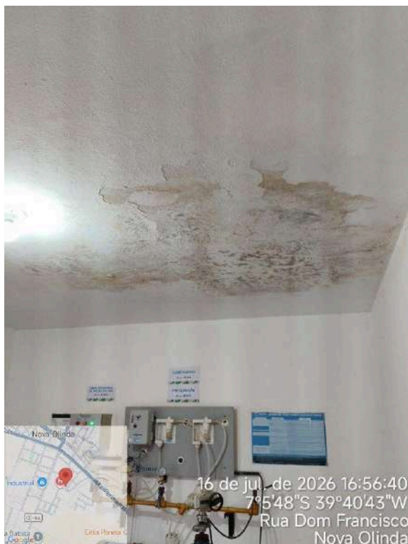
Foto 69 - ETA (Sede): sala de cloro com teto apresentando sinais de infiltração e pintura deteriorada.
