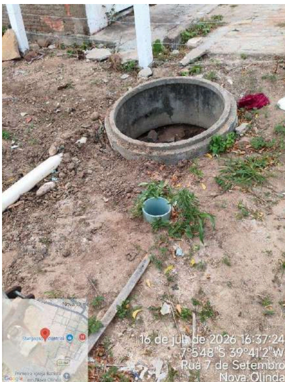
Foto 29 - PT-07 (Sede): registro desprovido de caixa de proteção; caixa de descarga desprovida de tampa.
