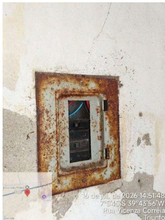
Foto 78 - Laboratório (Triunfo): instalações elétricas precárias.
