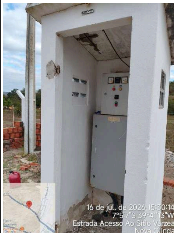
Foto 16 - PT-08 (Sede): casa do quadro de comando desprovida de porta.
