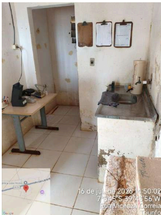
Foto 42 - ETA / Laboratório (Triunfo): móveis e infraestrutura de apoio precárias, e sem banheiro; paredes e pintura deterioradas.
