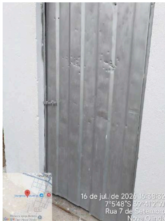
Foto 30 - PT-07 (Sede): portão da casa do quadro de comando desprovido de cadeado na tranca.
