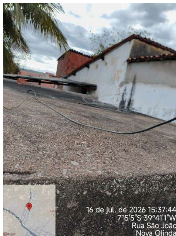
Foto 20 - RAP-02 / EEAT-02 ( Sede ): instalações elétricas sem eletrodutos de proteção.
