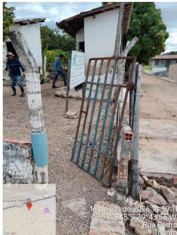
Foto 74 - ETA / Pátio (Triunfo): portão de acesso danificado.
