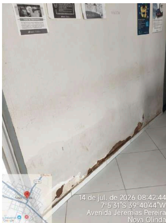
Foto 46 - Escritório Operacional / Loja de Atendimento ( Sede ): parede com parede e pintura deteriorados.
