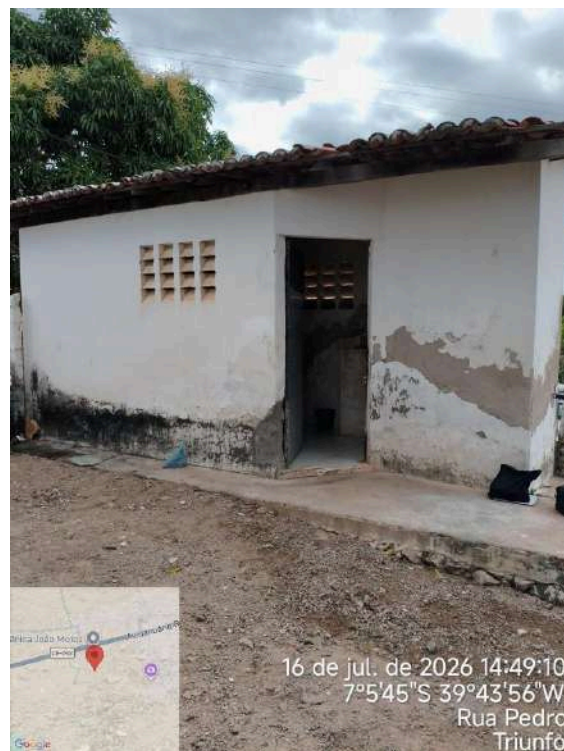
Foto 41 - ETA / Laboratório (Triunfo): sem identificação; paredes e pintura deteriorados.
