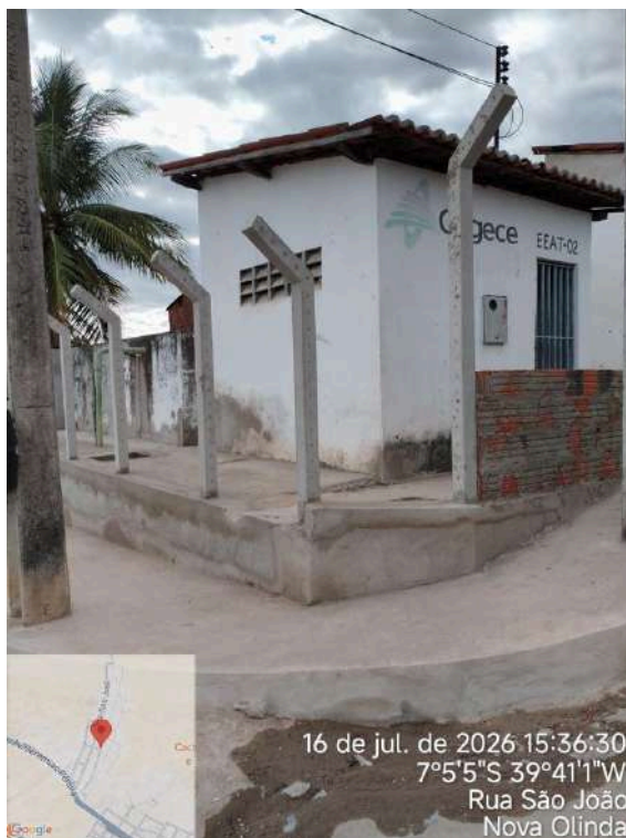
Foto 17 - RAP-02 / EEAT-02 ( Sede ): unidade em obras, caracterizando obra inacabada.
