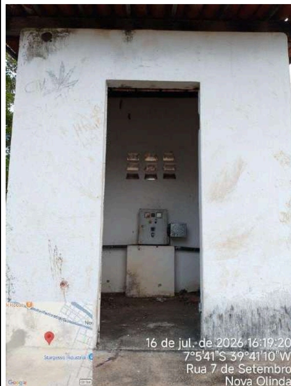
Foto 26 - PT-03 (Sede): pintura deteriorada; vão de acesso desprovido de porta; ausência de iluminação interna.
