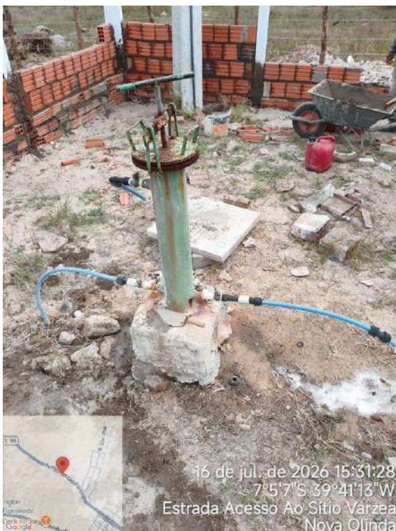
Foto 58 - PT-08 (Sede): clorador em processo de corrosão / oxidação.
