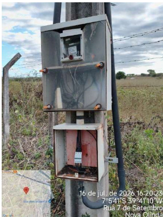
Foto 25 - PT-03 (Sede): quadro de disjuntor de energia desprovido de tampa.
