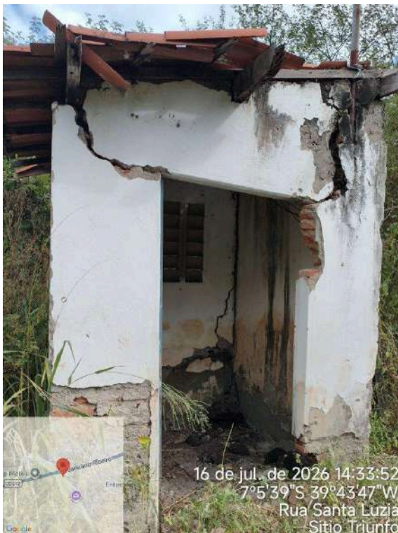
Foto 73 - PT-01 (Triunfo): casa do quadro de comando em processo de desabamento, com patologia estrutural caracterizada por rachaduras nas paredes.
