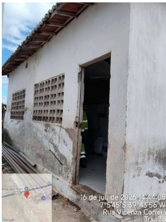
Foto 40 - ETA / Casa de Química_Almojarifado (Triunfo): sem identificação; paredes e pintura deteriorados.
