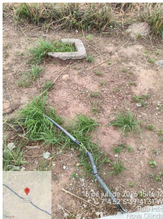
Foto 12 - PT-09 (Sede): caixa de proteção e inspeção desprovida de tampa; eletroduto danificado e exposto na área de circulação.
