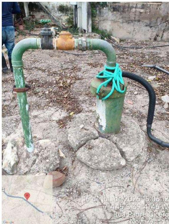
Foto 50 - PT-10 (Sede): laje de proteção do poço danificada.
