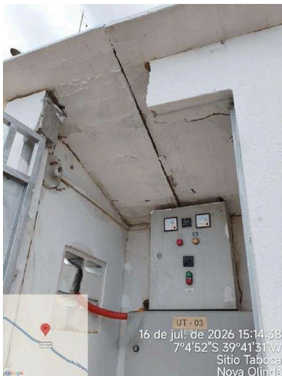
Foto 54 - PT-09 (Sede): casa do quadro de comando com rachaduras no teto; falta de lâmpada interna.
