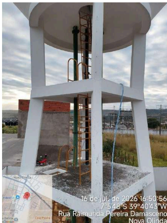
Foto 33 - REL-02 ( Sede ): patamares intermediários desprovidos de grade de proteção.
