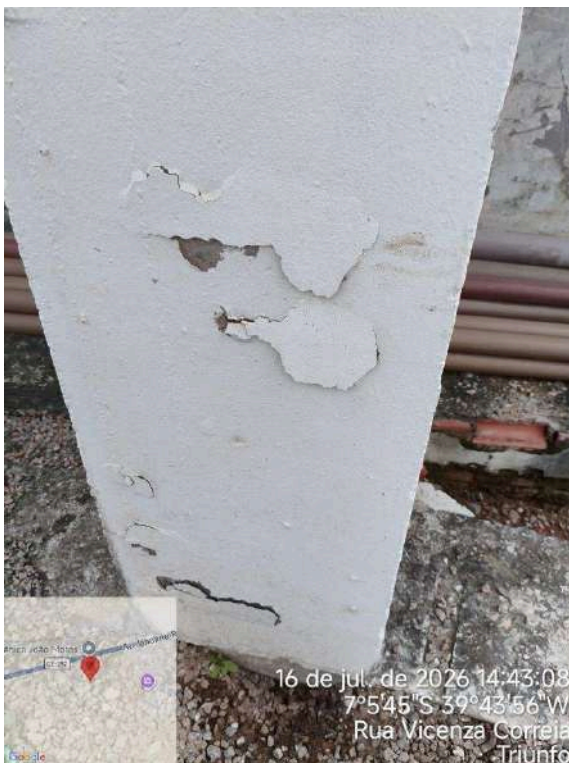
Foto 75 - ETA / REL-01 (Triunfo): pintura deteriorada; anomalias/patologia estrutural no concreto de um dos pilares do reservatório.
