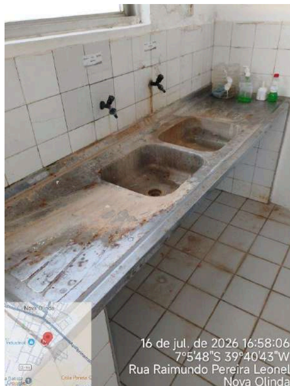
Foto 70 - ETA (Sede): laboratório com pia em processo avançado de oxidação.
