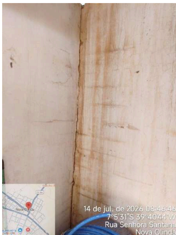
Foto 48 - Escritório Operacional / Loja de Atendimento ( Sede ): paredes com fissuras/rachaduras e pintura deteriorada.
