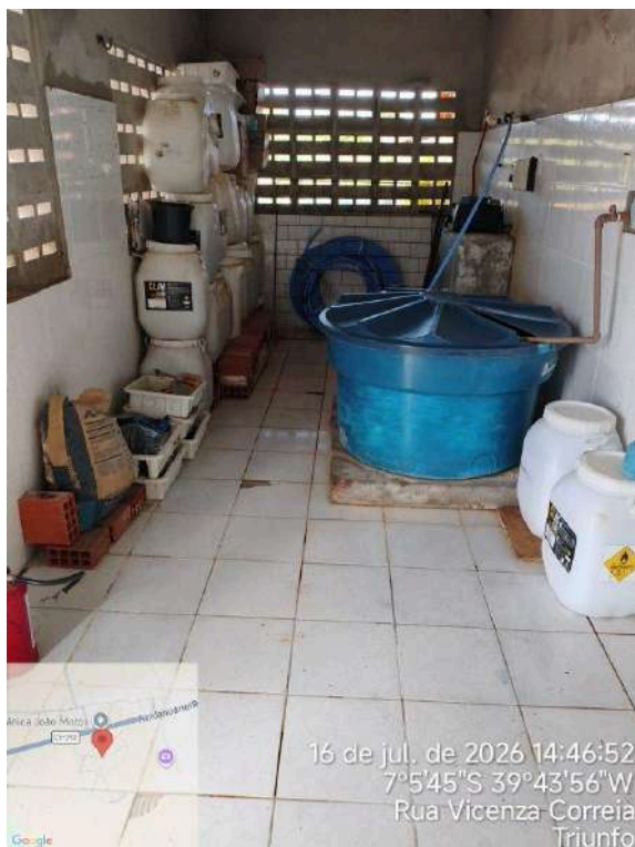
Foto 77 - ETA / Casa de Química_Almoxarifado (Triunfo): almoxarifado sem organização e controle adequados; pintura deteriorada.
