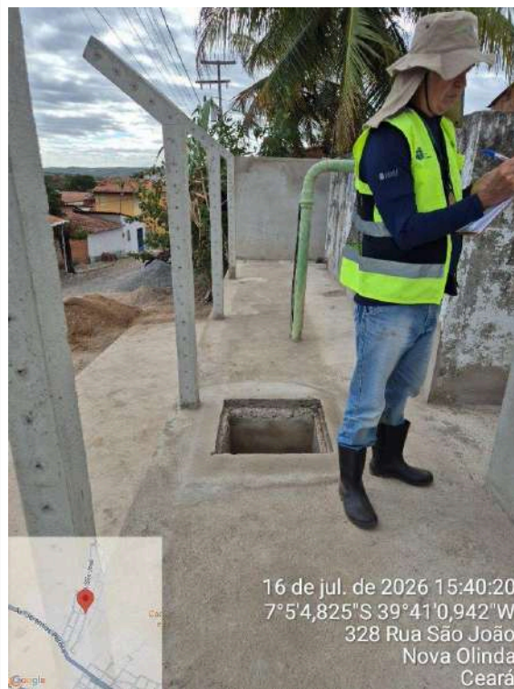
Foto 18 - RAP-02 / EEAT-02 ( Sede ): caixas de proteção e inspeção desprovidas de tampas.
