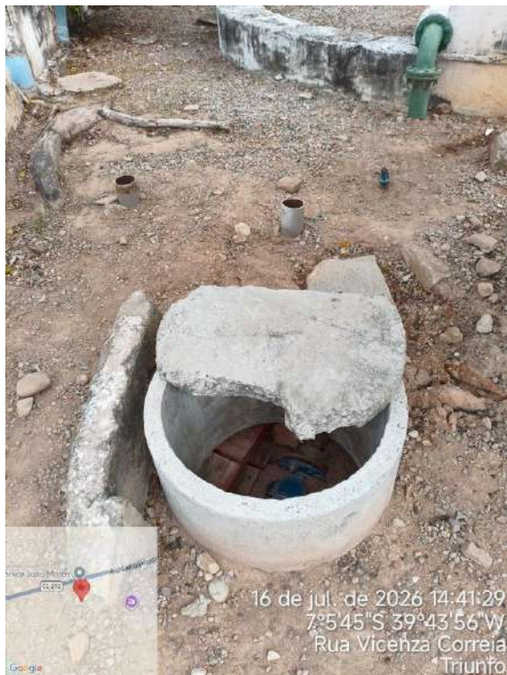
Foto 37 - ETA / Pátio (Triunfo): registros sem caixas de proteção e caixa com tampa danificada.
