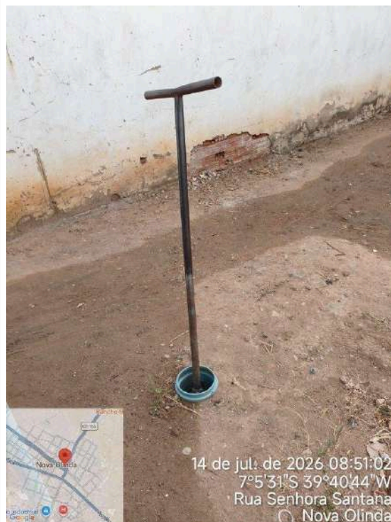
Foto 6 - RAP-03 / EEAT-03 (Sede): Registro desprovido de caixa de proteção adequada.
