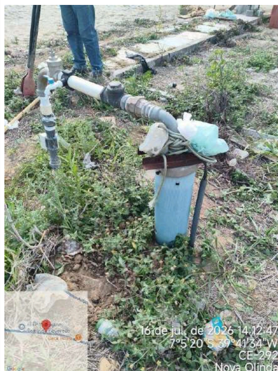
Foto 8 - PT-13 (Sede): Poço sem identificação e laje de proteção.
