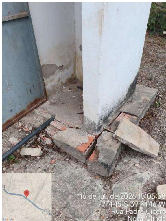
Foto 52 - PT-10 (Sede): casa do quadro de comando com anomalias estruturais e piso com sujidades.
