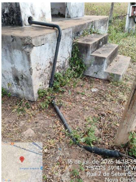
Foto 64 - PT-03 (Sede): pintura da casa de comando deteriorada; eletroduto de alimentação do poço danificado.
