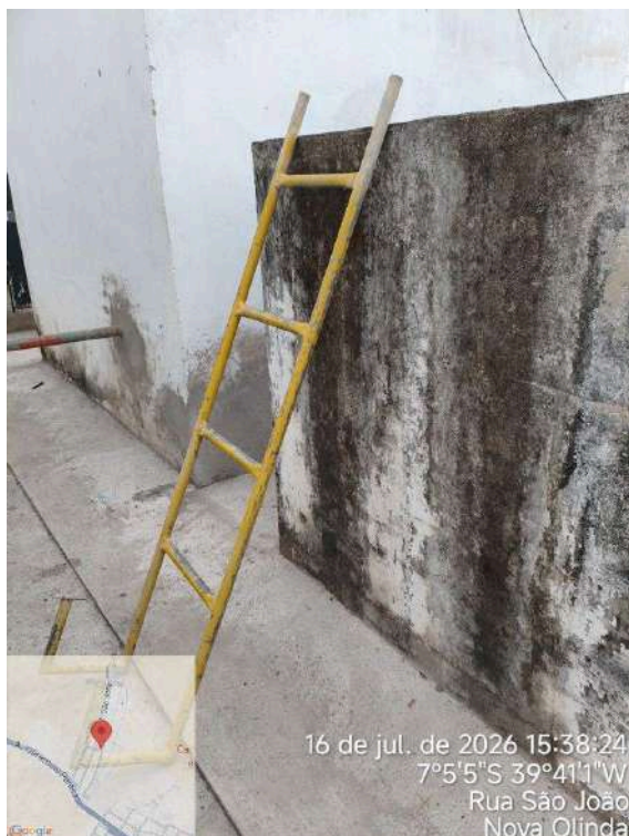
Foto 21 - RAP-02 / EEAT-02 (Sede): pintura deteriorada; escada de acesso sem fixação e ausência de grade de proteção da plataforma superior.
