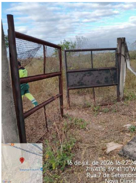
Foto 62 - PT-03 (Sede): portão de acesso danificado.
