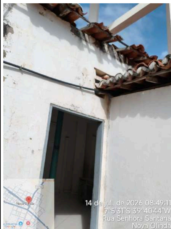
Foto 47 - Escritório Operacional / Loja de Atendimento ( Sede ): cobertura com telhado deteriorado.
