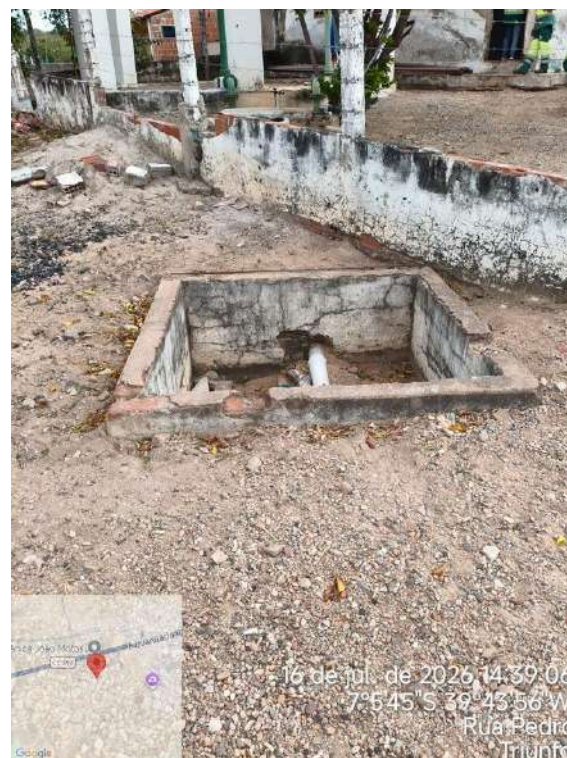
Foto 36 - ETA / Pátio ( Triunfo ): cerca e mureta danificados; caixa sem tampa ou grade de proteção.
