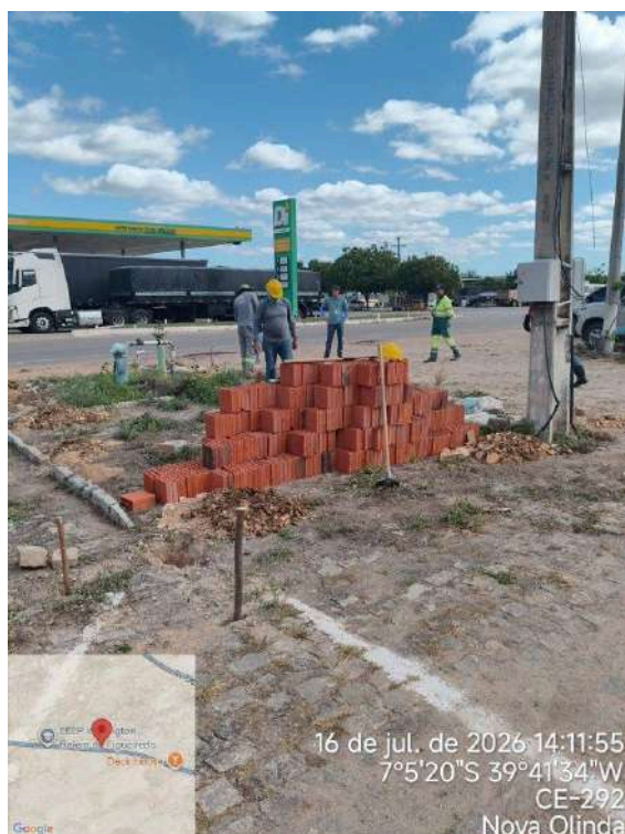
Foto 7 - PT-13 (Sede): Estrutura sem isolamento perimetral (unidade em obras) e sem iluminação.
