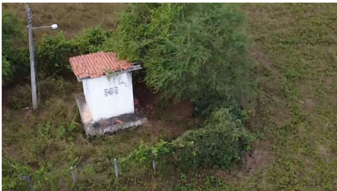
Foto 68 - PT-04 ( Sede ): proliferação de vegetação; casa do quadro de comando com telhado deteriorado.
