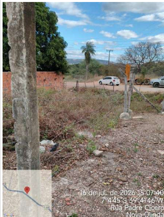
Foto 53 - PT-10 (Sede): cerca de proteção danificada.
