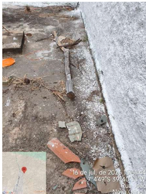
Foto 61 - REL-03 (Sede): área com sujidades.
