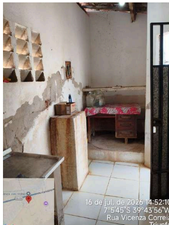
Foto 43 - ETA / Laboratório (Triunfo): móveis e infraestrutura de apoio precárias, e sem banheiro; paredes e pintura deterioradas.
