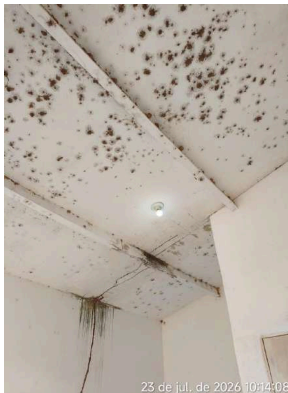
Foto 30 - Captação (EECS-01): casa do quadro de comando com pintura deteriorada.
