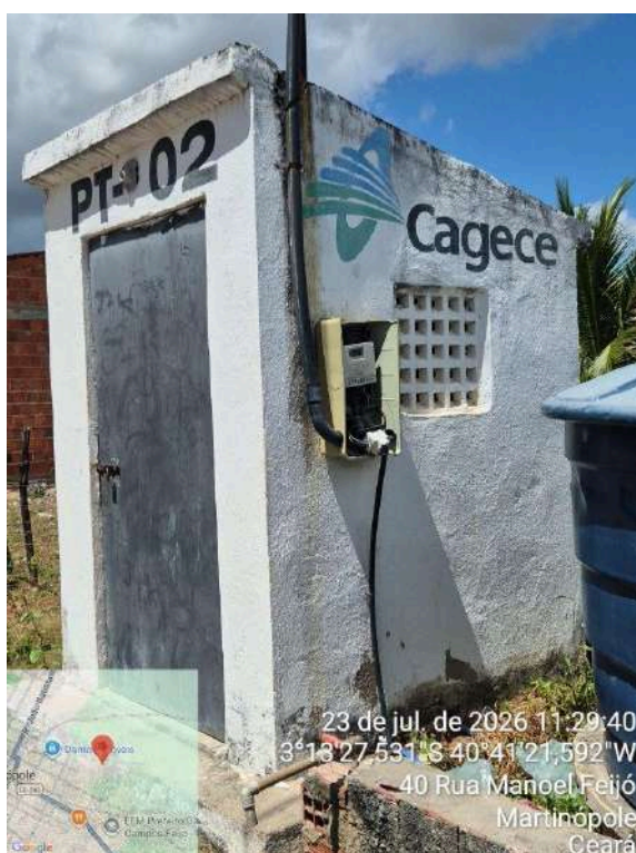
Foto 34 - PT-02: ausência de lâmpada externa; quadro de energia danificado com instalações expostas e acessíveis.
