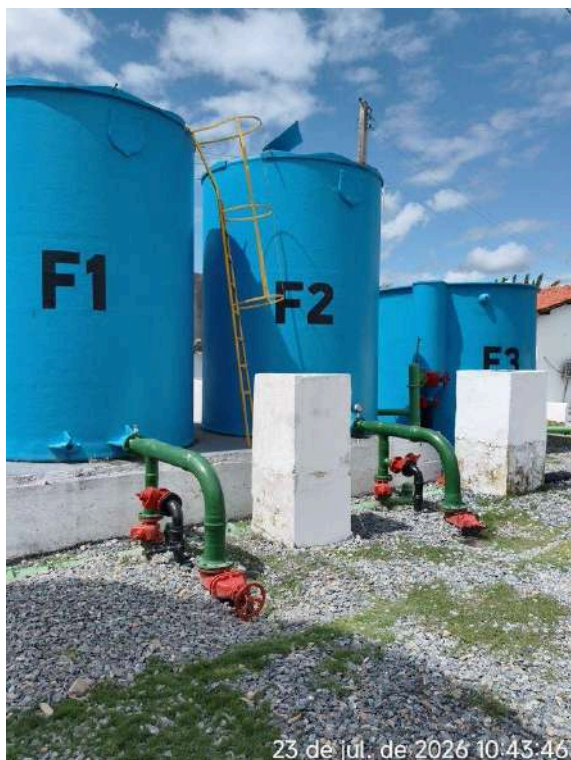
Foto 7 - ETA / Filtros: filtro nº 2 desprovido de escada de acesso.
