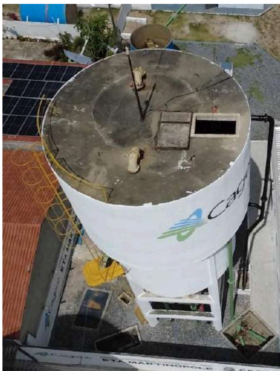
Foto 14 - ETA / REL-01: instalação elétrica inadequada; grade de proteção incompleta.
