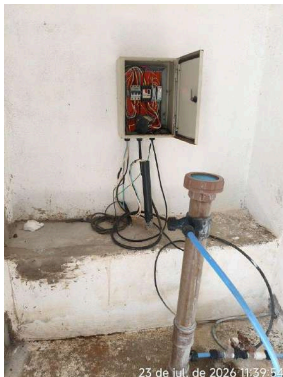
Foto 19 - PT-04: instalações elétricas precárias, sem isolamento de proteção.
