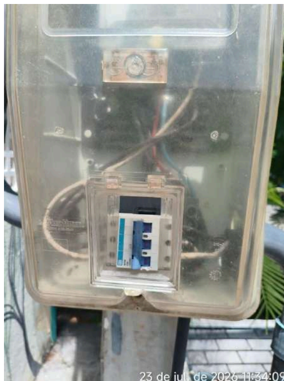
Foto 27 - PT-07: quadro de energia geral com chave exposta, acessível e vulnerável a ação de terceiros não autorizados.
