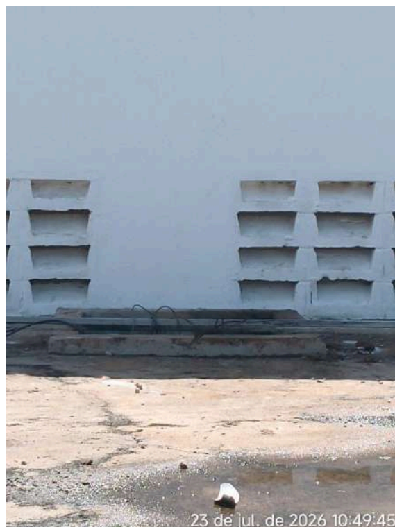
Foto 10 - ETA / RAP-01: instalações elétricas através da abertura de inspeção.
