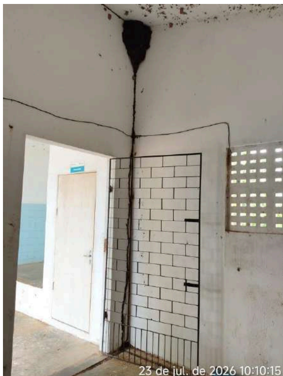
Foto 1 - Captação: instalações elétricas precárias, sem isolamento; proliferação de cupins.
