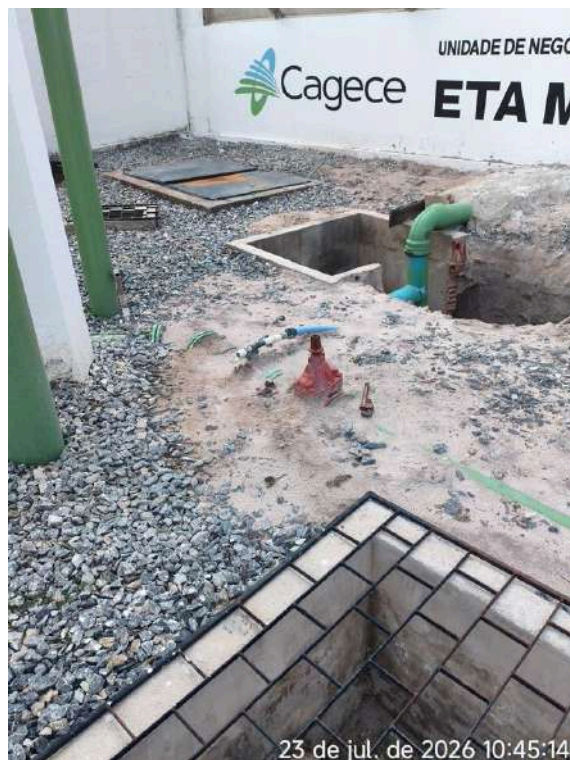
Foto 4 - ETA / Pátio: caixa sem tampa ou grade de proteção; registro sem caixa de proteção.
