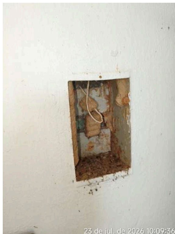
Foto 31 - Captação (EECS-01): casa do quadro de comando com quadro elétrico danificado e fiação exposta.
