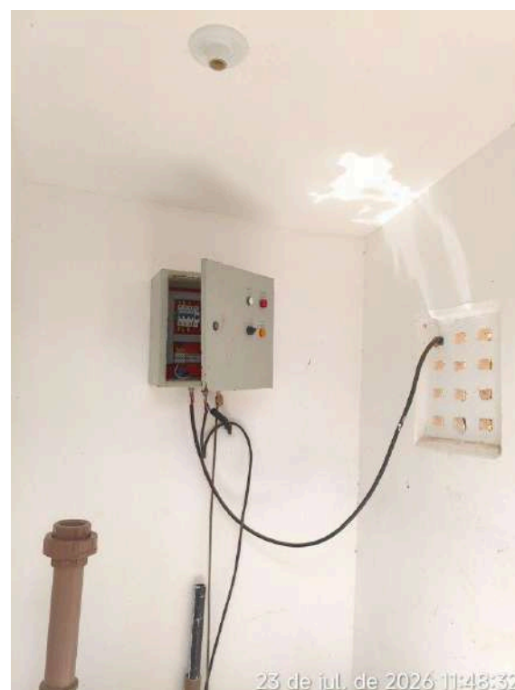
Foto 21 - PT-05: instalações elétricas sem proteção, implantadas através de cobogó.
