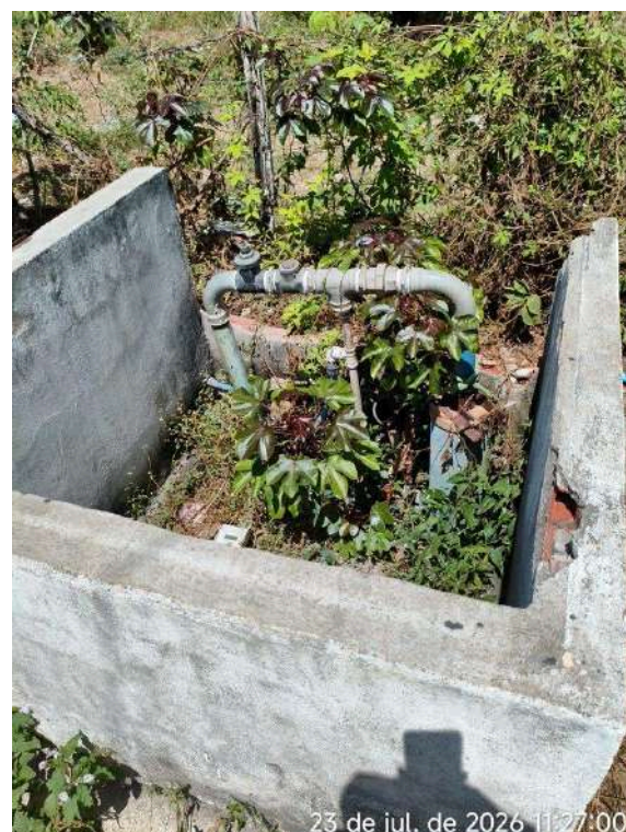
Foto 17 - PT-02: caixa de proteção do poço sem tampa ou grade de proteção.
