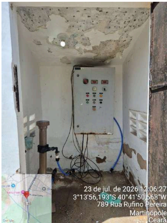
Foto 22 - PT-06: Paredes e teto deteriorados e instalações elétricas inadequadas.
