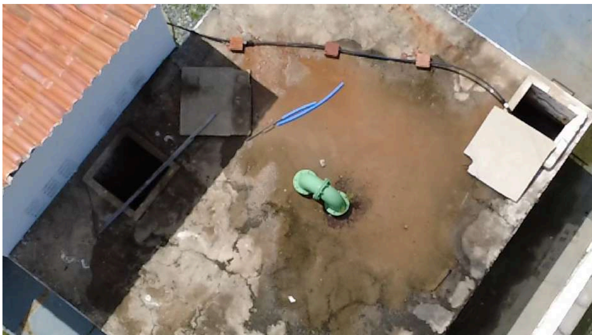
Foto 11 - ETA / RAP-01: sem grade de proteção na laje de cobertura; instalação através da abertura de inspeção; aberturas com tampas fora do lugar.
