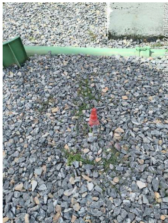
Foto 6 - ETA / Pátio: registro sem caixa de proteção.
