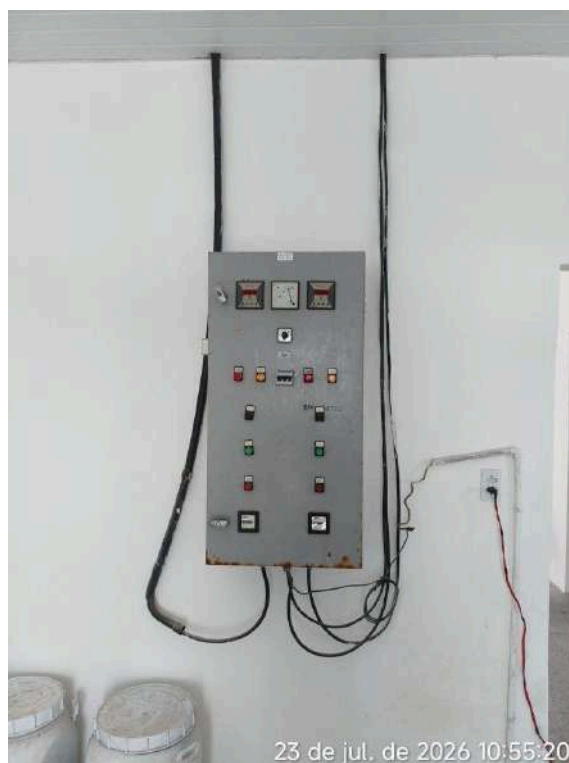
Foto 13 - ETA / ETRG: cabeamento elétrico desprovido de eletrodutos de proteção e isolamento.
