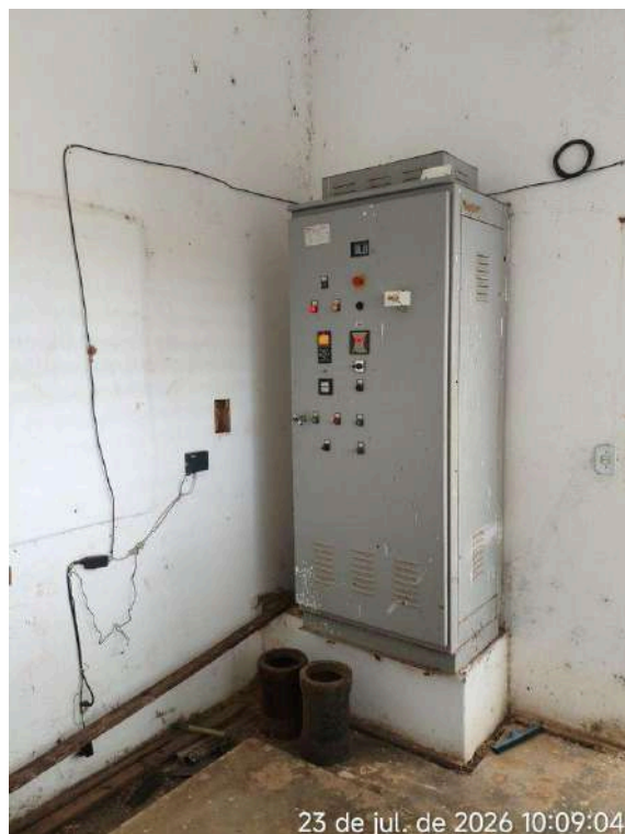
Foto 2 - Captação: instalações elétricas precárias, sem isolamento.
