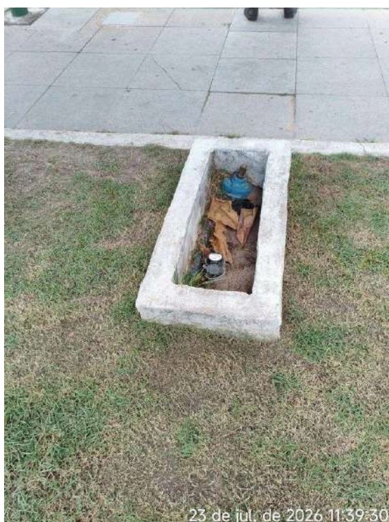
Foto 20 - PT-04: caixa desprovida de tampa
