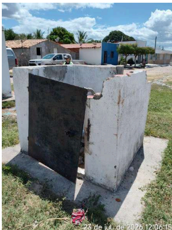
Foto 24 - PT-06: caixa de proteção do poço danificada e sem tampa ou grade de proteção.
