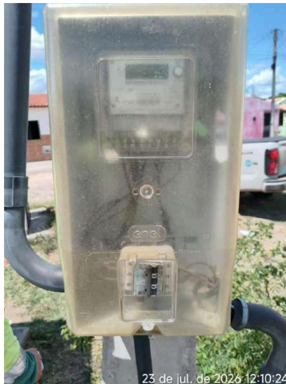
Foto 23 - PT-06: quadro geral de energia com disjuntor exposto e acessível.
