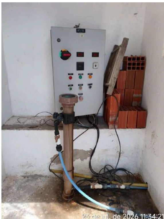
Foto 26 - PT-07: cabecamento em excesso, enrolado sobre o piso sem isolamento de proteção.
