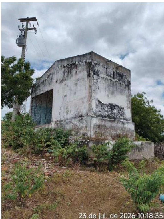
Foto 29 - Captação (EECS-01): casa do quadro de comando com pintura deteriorada.
