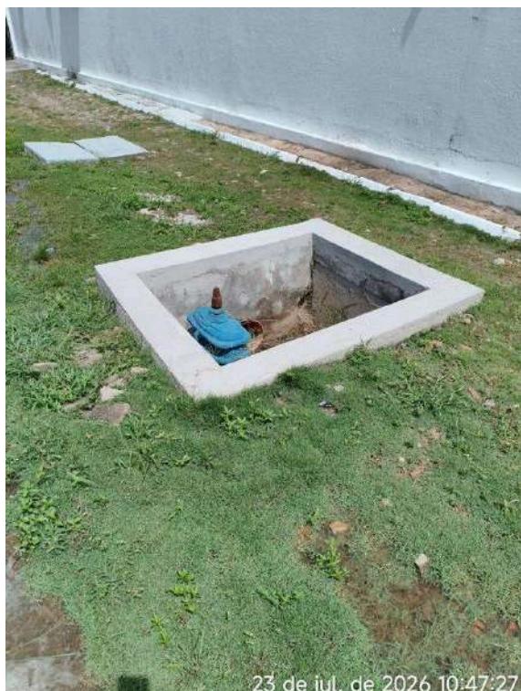
Foto 5 - ETA / Pátio: caixa sem tampa ou grade de proteção.
