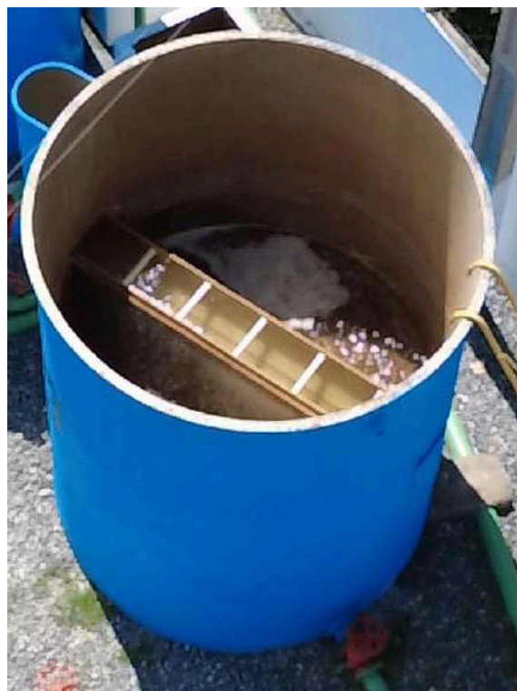
Foto 8 - ETA / Filtros: filtro nº 3 desprovido de tampa.
