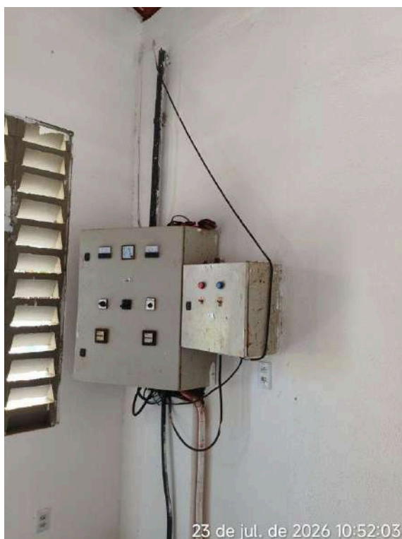
Foto 12 - ETA / EEAT-01: cabeamento elétrico desprovido de eletrodutos de proteção e isolamento.
