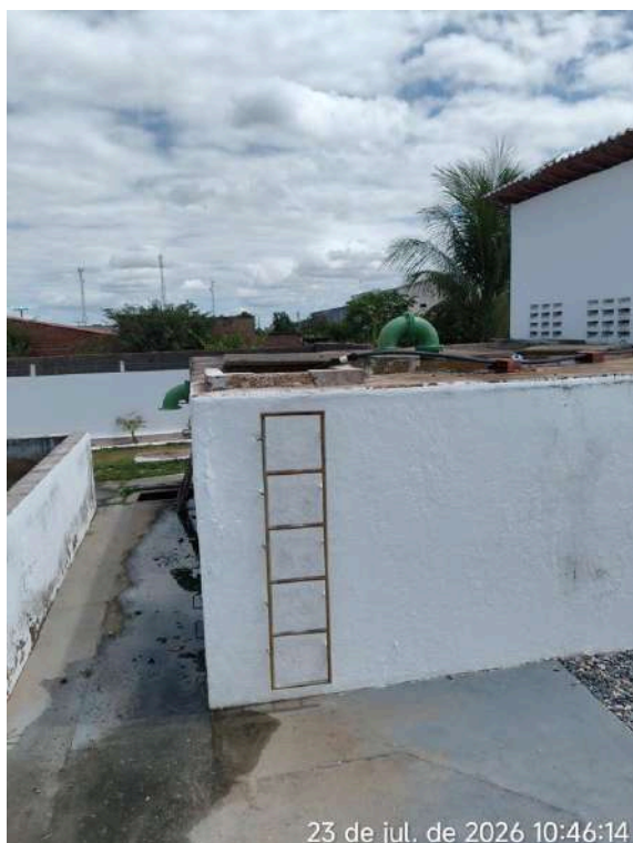
Foto 9 - ETA / RAP-01: escada sem corrimão acima do patamar superior; laje de cobertura sem grade de proteção; tubulação / eletroduto através da abertura de inspeção.
