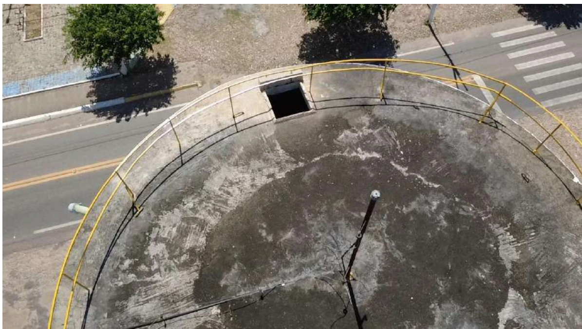
Foto 28 - ETA / REL-02: tampa da abertura de inspeção aberta/fora de posição.
