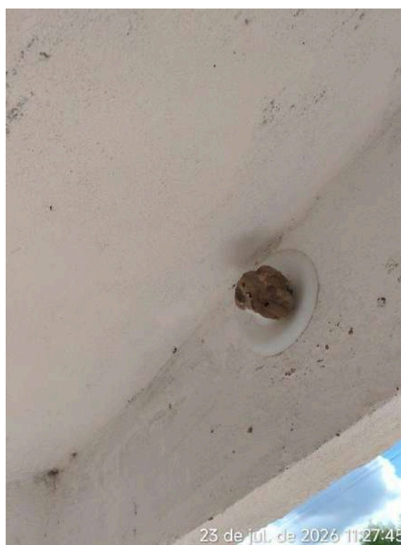
Foto 35 - PT-02: ausência de lâmpada interna.
