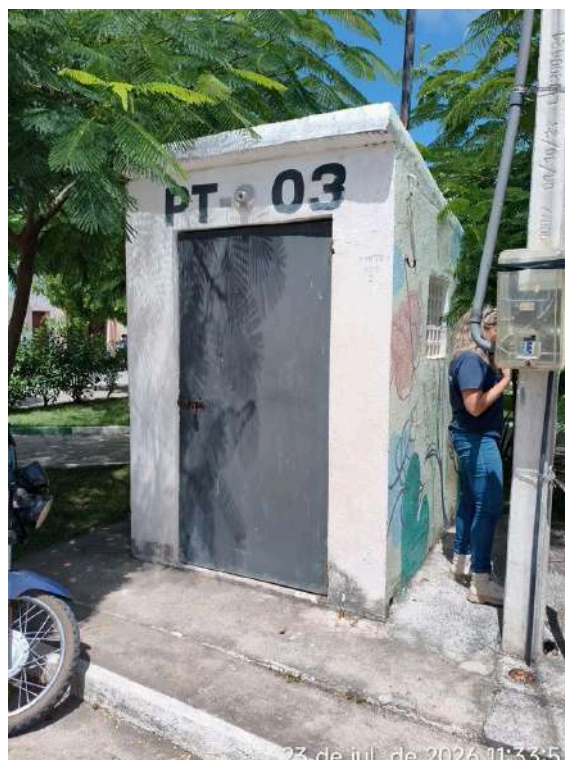
Foto 25 - PT-07: identificação inadequada pois a casa do quadro de comando do PT-03 (desativado) aciona o PT-07.
