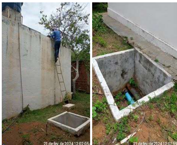
Foto 9 - RAP-01 (Palestina): caixas de proteção e inspeção sem tampas.
