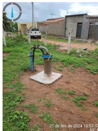
Foto 6 - PT-08 (Sede): poço está sem iluminação externa.
