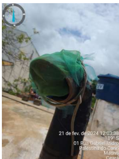
Foto 27 - RAP-01 (Palestina): tubulação de respiro com tela mal instalada.
