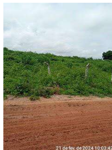
Foto 40 - ETE: cerca de isolamento e proteção está danificada.
