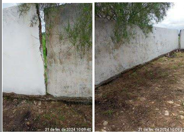
Foto 18 - PT-05 (Sede): Infraestrutura em recuperação e reformas, apresentando erosão da área do pátio interno, muro com rachaduras, desabando.
