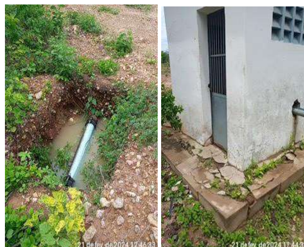
Foto 32 - PT-01 (Palestina): vazamento na tubulação e calçada deteriorada.
