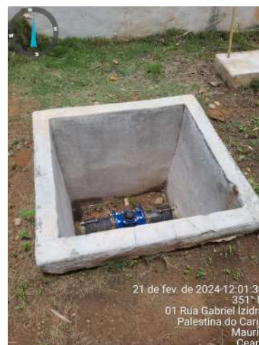
Foto 10 - REL-01 (Palestina): caixa de macromedicação sem tampa/grade.
