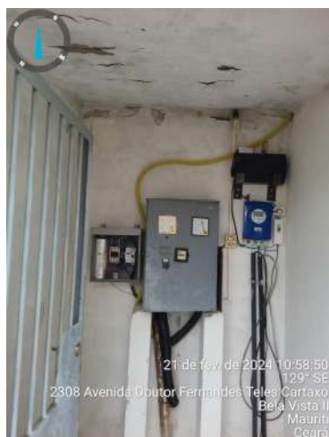
Foto 21 - REL-03 (Sede): pintura deteriorada e quadro de banco capacitor sem tampa.
