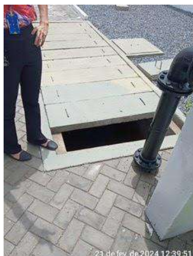
Foto 31 - PT-03 (Palestina): tampa de proteção da caixa de inspeção fora do lugar.
