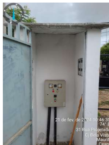
Foto 4 - PT-07 (Sede): falta iluminação na casa do quadro de bombas.
