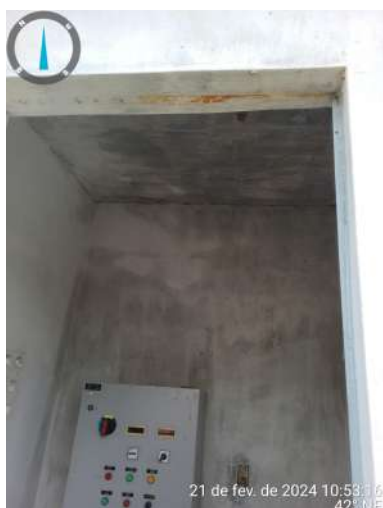
Foto 5 - PT-08 (Sede): poço está sem iluminação interna.
