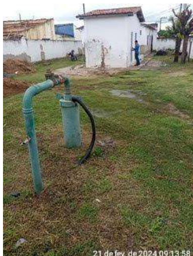
Foto 41 - PT-01 (Sede): a área do pátio do poço fica lamacenta quando chove, pois não é pavimentada e nem drenada adequadamente.
