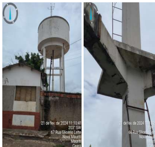
Foto 44 - REL-01 (Sede): instalações desativadas em definitivo.
