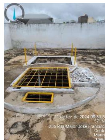
Foto 34 - EEE-01: a grade de proteção da abertura do poço tem espaçamento grande entre as barras; câmara de rejeitos saturada de acúmulo de material.
