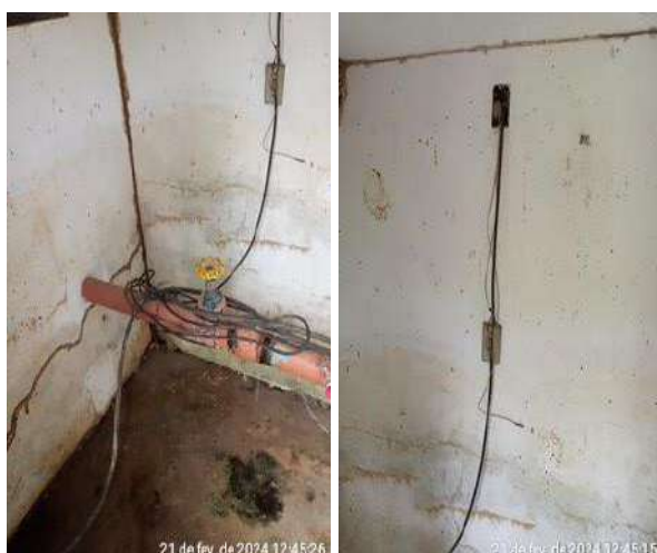
Foto 13 - PT-01 (Palestina): instalações elétricas sem eletroduto de isolamento e proteção e caixa elétrica sem espelho de proteção.
