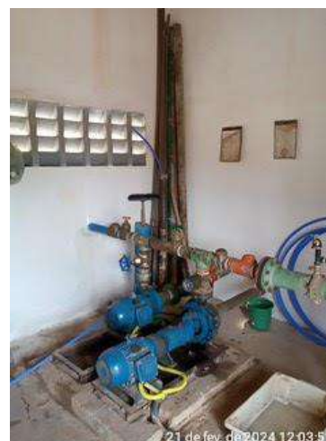
Foto 22 - EE-01 (Palestina): materiais armazenados de forma inadequada e improvisada na casa de bombas da elevatória.
