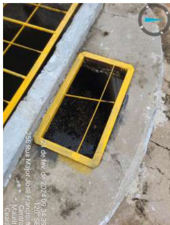
Foto 35 - EEE-01: a grade de proteção da abertura do poço tem espaçamento grande entre as barras.
