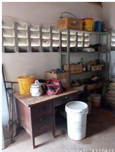
Foto 23 - EE-01 (Palestina): materiais armazenados de forma inadequada e improvisada na casa de bombas da elevatória.
