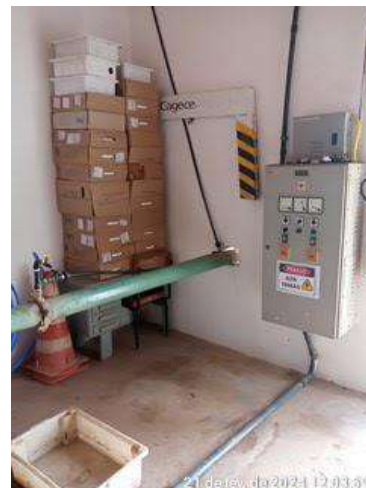
Foto 24 - EE-01 (Palestina): materiais armazenados de forma inadequada e improvisada na casa de bombas da elevatória.
