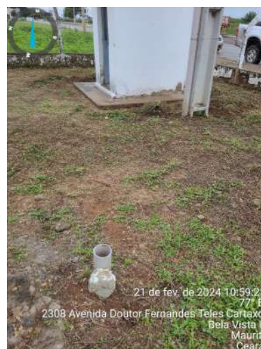
Foto 8 - PT-20, PT-06 e REL-03 (Sede): registro sem caixa de inspeção.
