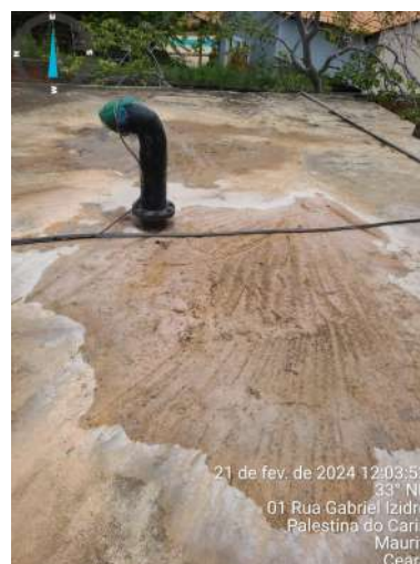
Foto 28 - RAP-01 (Palestina): fiação elétrica sobre a laje e sem eletroduto de isolamento e proteção.
