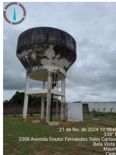
Foto 20 - REL-03 (Sede): pintura deteriorada e identificação apagada.
