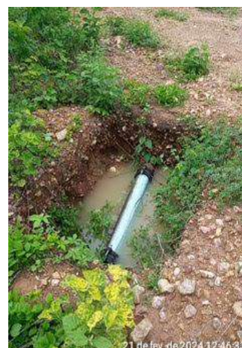
Foto 12 - PT-01 (Palestina): vazamento na tubulação (buraco aberto).
