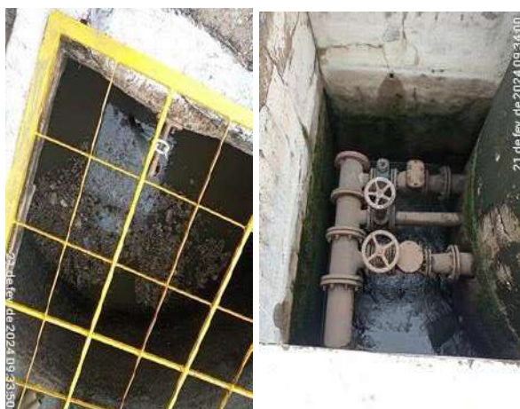
Foto 33 - EEE-01: foi detectada a presença de sobrenadante no poço de sucção.
