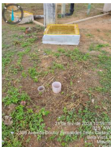
Foto 7 - PT-06 e REL-03 (Sede): registro sem caixa de inspeção.
