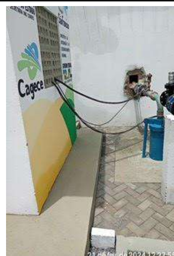
Foto 14 - PT-03 (Palestina): instalações elétricas sem eletroduto de isolamento e proteção.
