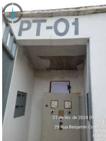
Foto 17 - PT-01 (Sede): casa do quadro de comando com o revestimento da laje deteriorada.
