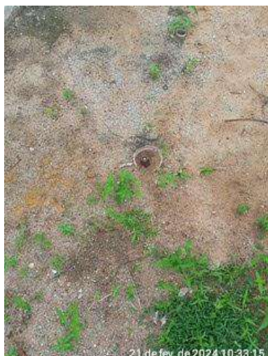
Foto 3 - REL-02 (Sede): registro sem caixa de inspeção.
