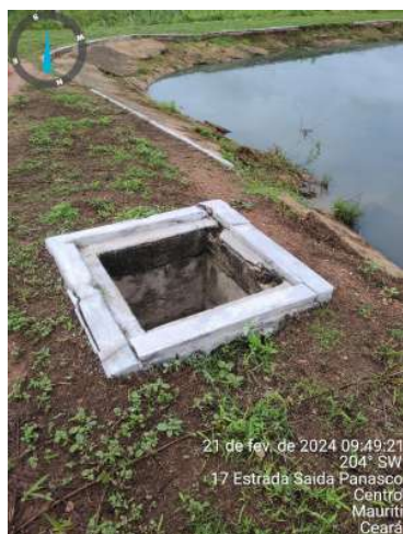
Foto 39 - ETE: taludes das lagoas estão em processo de erosão; caixa de distribuição dos esgotos deteriorada.
