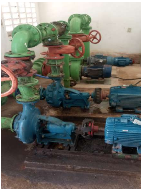
Foto 11- EEAT-02: casa de bombas apresenta falha na drenagem da água de arrefecimento das bombas e acúmulo de água no piso.
