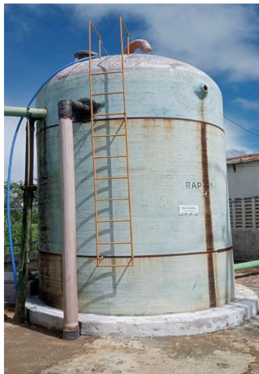
Foto 2 - ETA / RAP-01: escada tipo marinho inadequada, sem gaiola de proteção e sem patamar/plataforma superior com grade de proteção.
