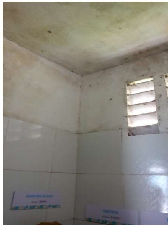
Foto 22 - ETA / laboratório: apresenta pintura deteriorada e sem refrigeração.
