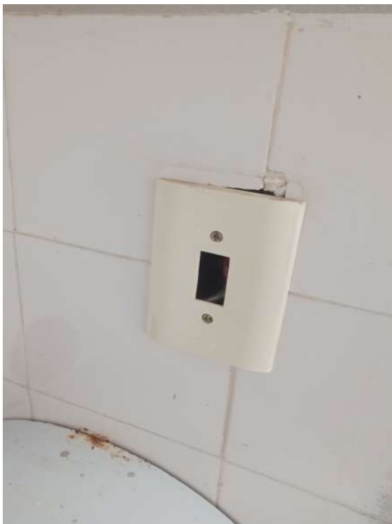
Foto 5 - Escritório Operacional / almoxarifado: espelho interruptor da lâmpada danificado.
