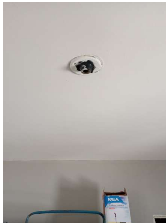
Foto 4 - Escritório Operacional /Almoxarifado: almoxarifado sem lâmpada.
