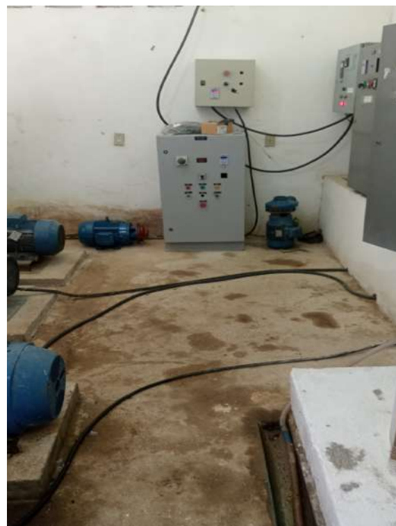
Foto 12- EEAT-02: fios sobre o piso e sem eletrodutos de proteção e isolamento.
