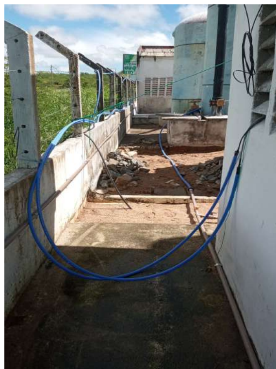
Foto 20 - ETA / polímero e cloro): instalações hidráulicas de água e de condução do tratamento químico estão inadequadas com tubos instalados sobre o piso da área de circulação da ETA.
