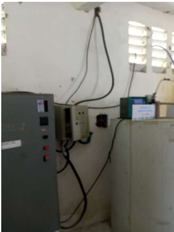
Foto 15 - EEAT-02: instalações elétricas estão inadequadas com caixas de passagem sem tampas.
