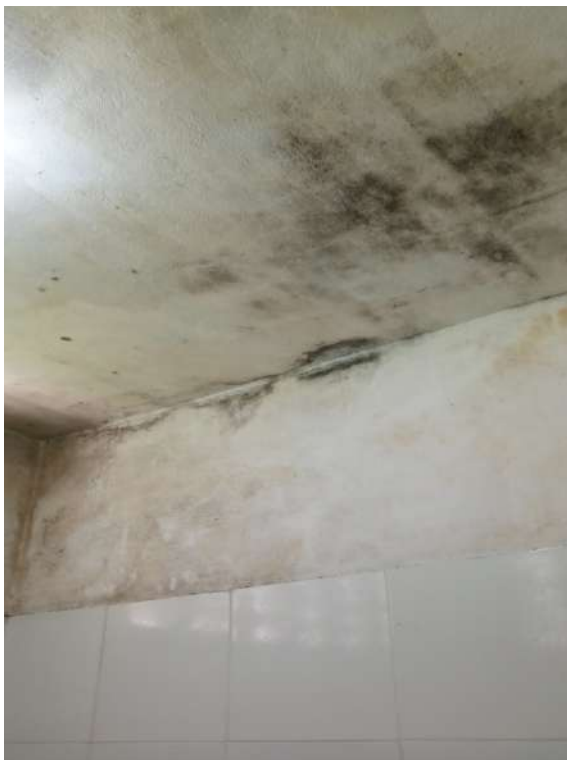
Foto 21 - ETA / laboratório: apresenta pintura deteriorada e sem refrigeração.
