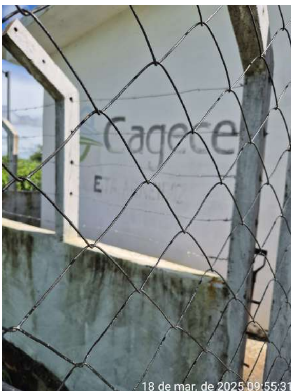
Foto 7 - ETA / F-01: apresentam identificação e pintura desgastadas
