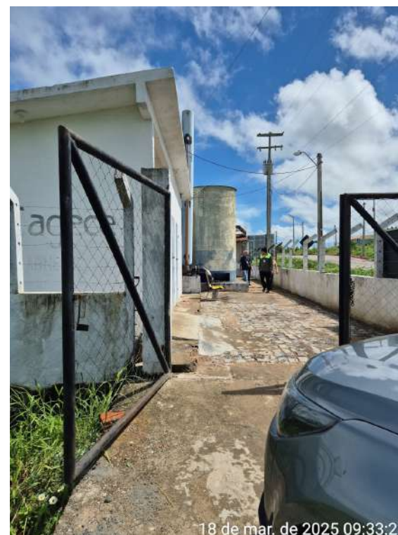
Foto 8 - ETA / F-01: apresentam identificação e pintura desgastadas.
