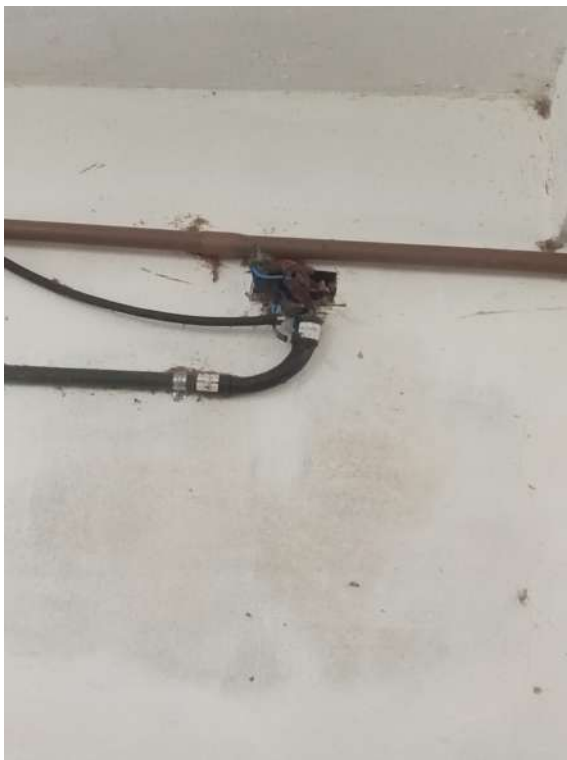
Foto 13 - EEAT-02: instalações elétricas estão inadequadas com caixas de passagem sem tampas.
