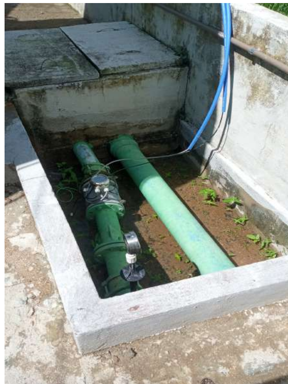
Foto 18 - ETA (macromedicação): caixa de macromedicação sem tampa de proteção.
