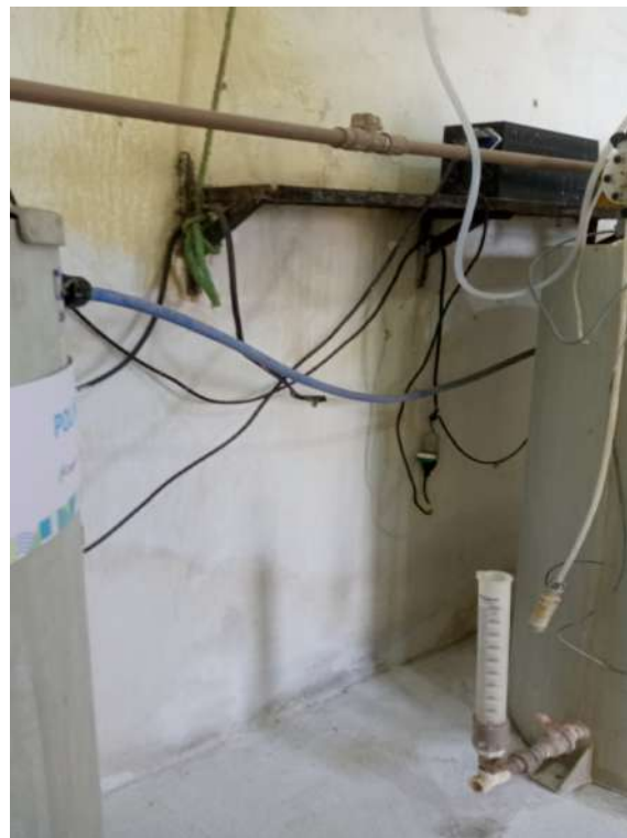
Foto 14 - EEAT-02: instalações elétricas estão inadequadas com caixas de passagem sem tampas.
