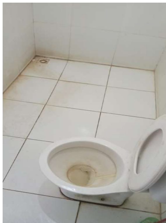
Foto 24 - ETA / banheiro: apresenta pintura deteriorada; equipamentos e revestimentos laváveis encardidos.
