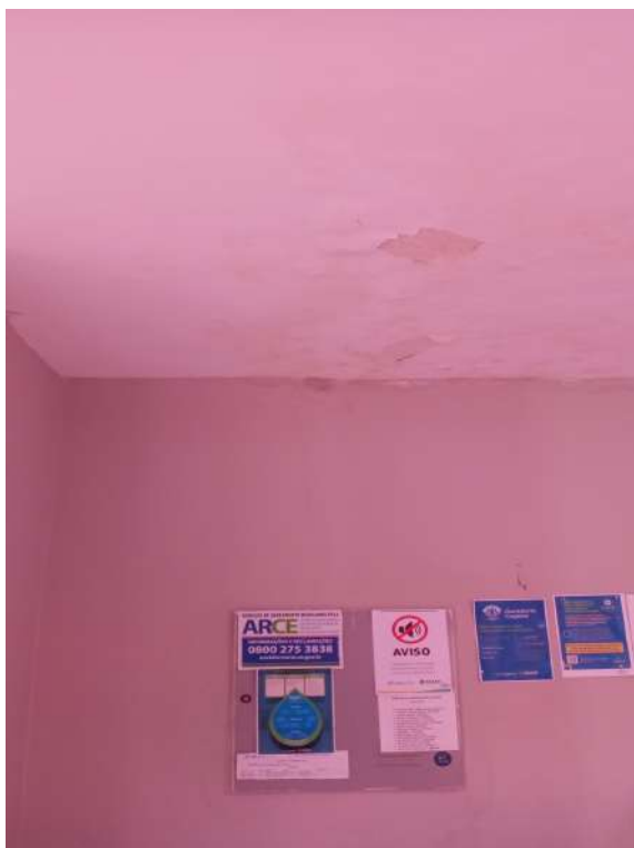
Foto 3 - Escritório Operacional / almoxarifado: apresenta forro e paredes com pintura deteriorada.
