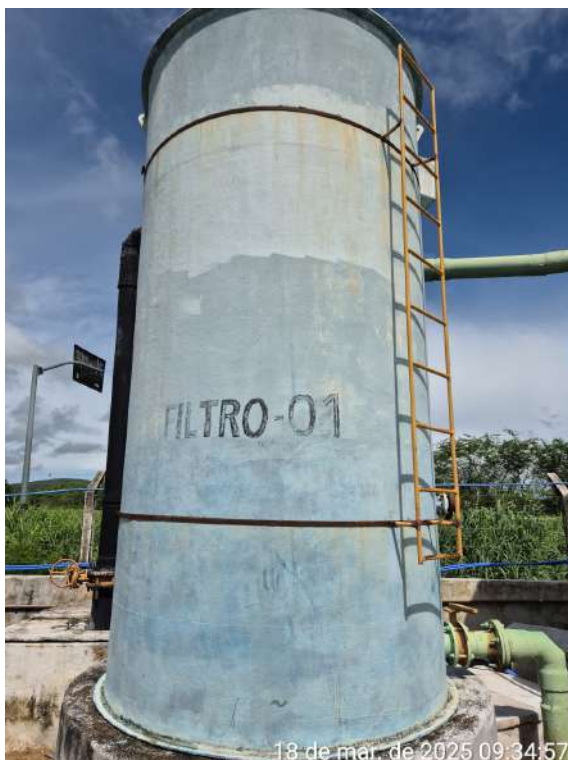
Foto 9 - ETA (F-01): desativado; pintura e identificação desgastadas; escada tipo marinheiro inadequada.
