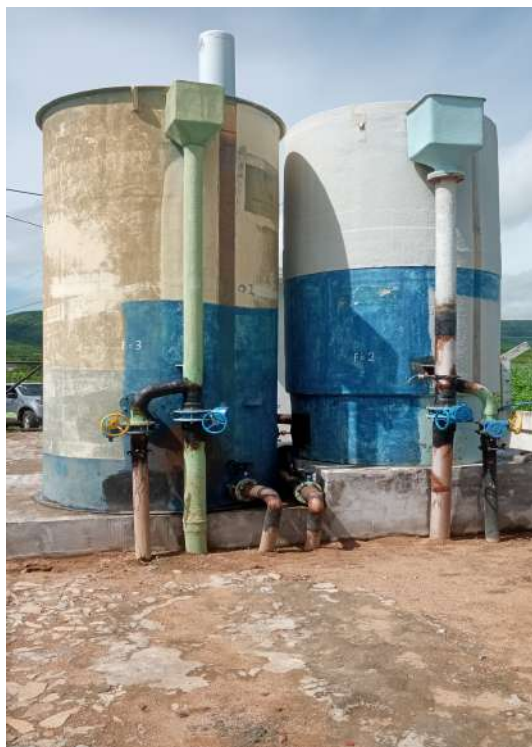
Foto 1 - ETA / Filtros F-02 e F-03: ausência de tampas e não tem escada de acesso tipo marinho.
