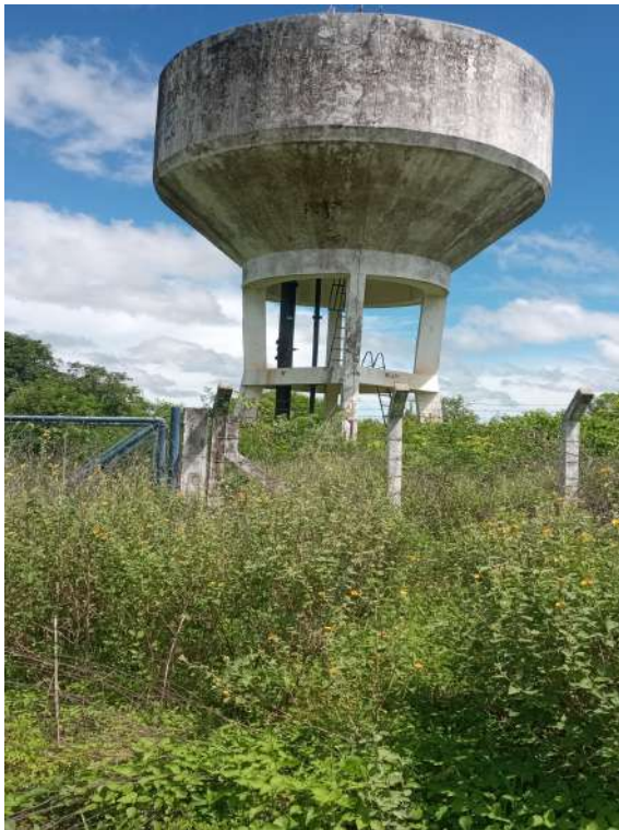
Foto 25 - REL-01 (desativado): infraestrutura fora de operação, cerca de proteção danificada e vegetação crescida, denotando abandono total.
