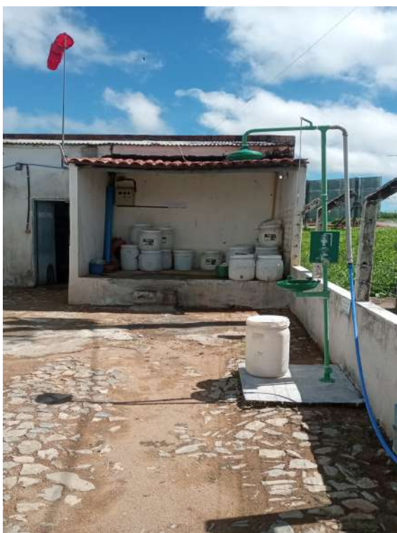
Foto 19 - ETA / polímero e cloro): instalações hidráulicas de água estão inadequadas com tubos instalados sobre o piso da área de circulação da ETA.
