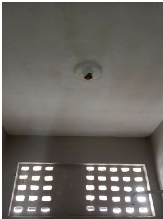
Foto 6 - Escritório Operacional / almoxarifado: banheiro sem lâmpada.
