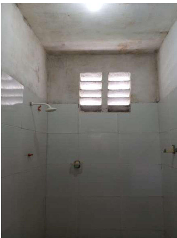
Foto 23 - ETA / banheiro: apresenta pintura deteriorada; equipamentos e revestimentos laváveis encardidos.
