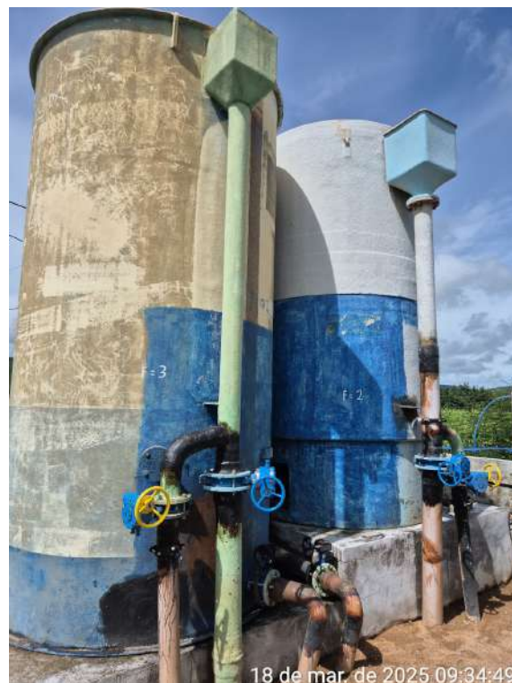
Foto 10- ETA (F-02 / F-03): pintura e identificação desgastadas.
