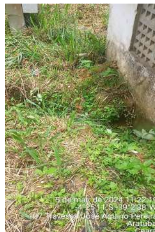
Foto 10 - EERD-02: registro sem caixa de proteção e inspeção.
