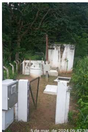
Foto 5 - RAP-04 / EEAB-02 / PT-02: estruturas sem identificação e caixa sem tampa.
