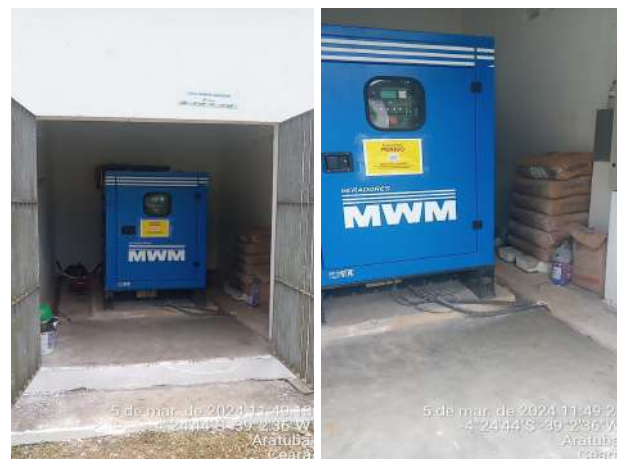
Foto 50 - EERD-02: buracos na área do pátio e mato crescido.
