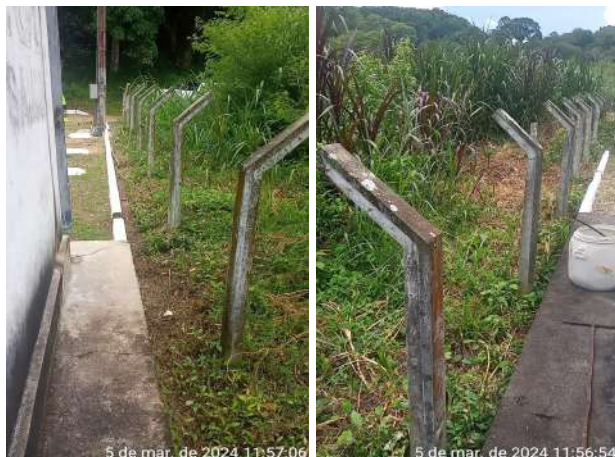
Foto 47 - Área do pátio: cerca danificada.
