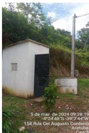
Foto 3 - PT-08 e PT-09: ausência de identificação; sem iluminação interna e externa; poço sem laje de proteção.
