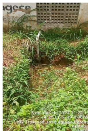
Foto 46 - EERD-02: buracos na área do pátio e mato crescido.
