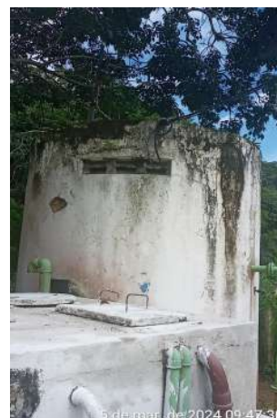
Foto 26 - RAP-04 / EEAB-02 / PT-02: pinturas da casa de bombas e RAP estão deterioradas; mato crescido em cima da laje da casa de bombas.
