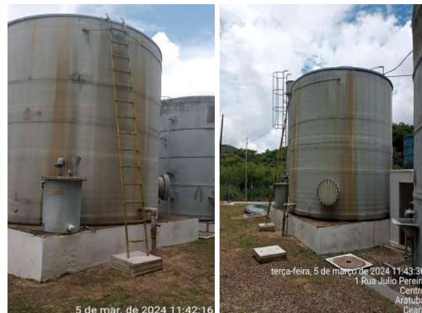
Foto 48 - Reatores: pintura deteriorada, escadas corroídas e guarda-corpo danificado.
