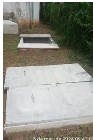
Foto 6 - RAP-04 / EEAB-02 / PT-02: estruturas sem identificação e caixa sem tampa.
