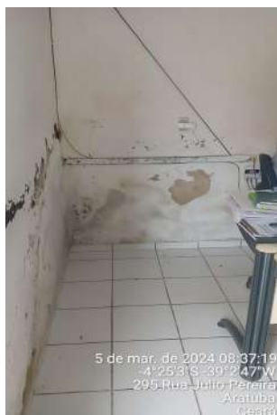
Foto 19 - Escritório / Almojarifado: paredes com pintura deteriorada e infiltração; teto do banheiro com revestimento danificado e lâmpadas em falta no almojarifado.
