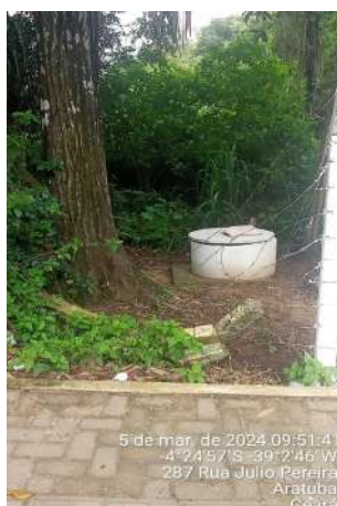
Foto 27 - PT-03: cerca danificada.
