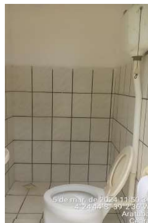
Foto 14 - Casa do operador: não existe casa de apoio ao operador, apenas banheiro.
