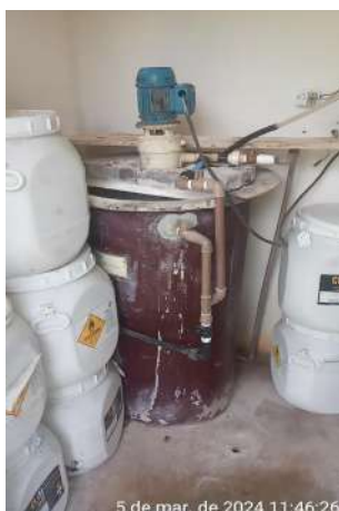
Foto 15 - Sistema de Aeração / depósito / casa de química: o sistema de desinfecção está instalado de maneira inadequada junto com estocagem de produtos químicos.
