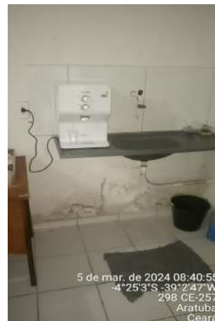
Foto 18 - Escritório / Almojarifado: paredes com pintura deteriorada e infiltração; teto do banheiro com revestimento danificado e lâmpadas em falta no almojarifado.
