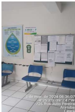
Foto 17 - Escritório / Almojarifado: paredes com pintura deteriorada e infiltração; teto do banheiro com revestimento danificado e lâmpadas em falta no almojarifado.
