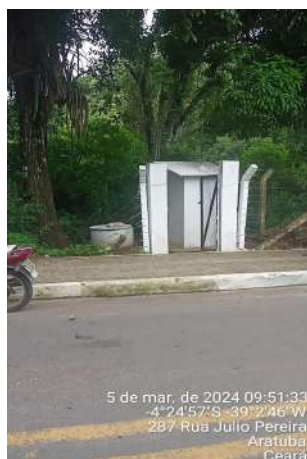
Foto 7 - PT-03: poço sem identificação e casa do quadro de comando sem porta.
