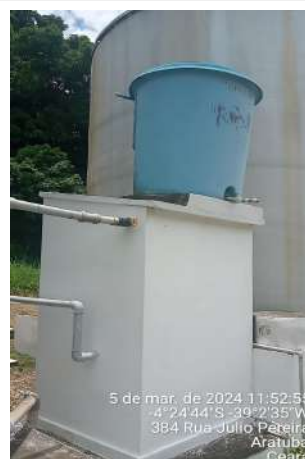
Foto 16 - Sistema de Aeração / depósito / casa de química: sistema alternativo de desinfecção montado em cima da casa de bombas do sistema de aeração, sem escada de acesso e grade de proteção (guarda-corpo).
