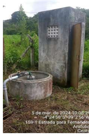
Foto 8 - PT-07: ausência de identificação; poço sem laje de proteção; não há iluminação na área do poço e sem iluminação para trabalhos noturnos.
