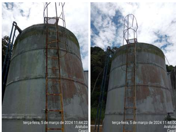
Foto 49 - Reatores: pintura deteriorada, escadas corroídas e guarda-corpo danificado.
