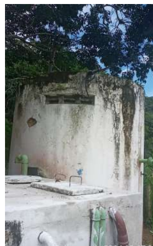
Foto 56 - RAP-04: sem guarda corpo de proteção na laje.
