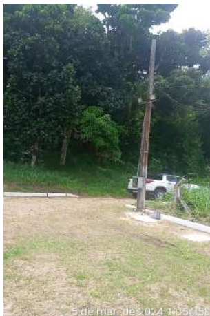
Foto 11 - Área do pátio: existe apenas um poste de iluminação na entrada, que não é suficiente para atender toda a área da ETE.
