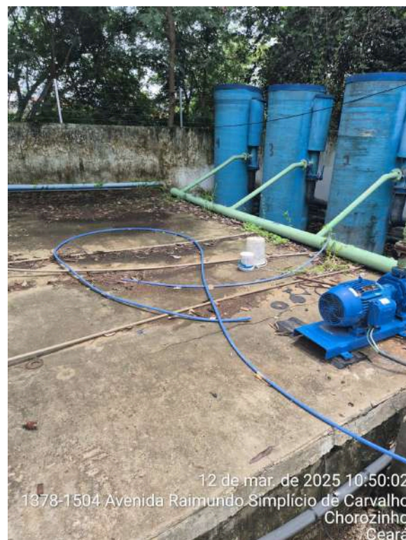
Foto 28 - Captação (Triângulo): filtros e torre de nível estão desativados.
