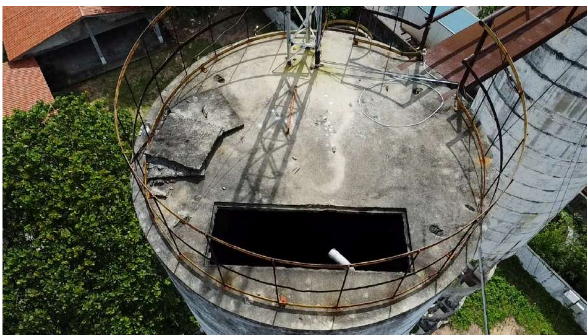
Foto 37 - REL-06 e REL-07 (Timbaúba dos Marinheiros): reservatórios com pintura desgastada; passarela de acesso aos reservatórios em acentuada oxidação; escada em estado de oxidação; peças enferrujadas; ausência de tampa; fiação inadequada.
