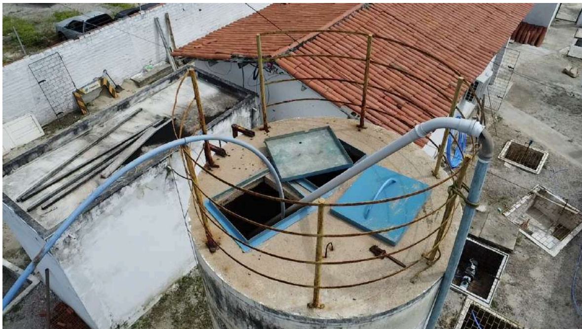
Foto 23 - Torre de nível (Triângulo): com tampas deslocadas, pintura deteriorada, peças enferrujadas e armação exposta.
