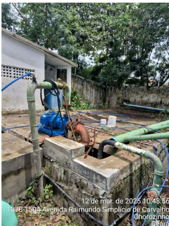
Foto 27 - Captação / RAP-01 (Triângulo): RAP sem tampa e com cordas ao redor da estrutura.
