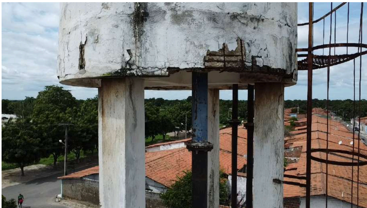
Foto 16 - REL-01 / REL-02 (Triângulo): Armação das pilares dos reservatórios exposta, sem recobrimento, aumentando o processo de depreciação da estrutura e as fragilizando, podendo colocar em risco os operadores e visitantes; passarela de acesso aos reservatórios em acentuada oxidação.
