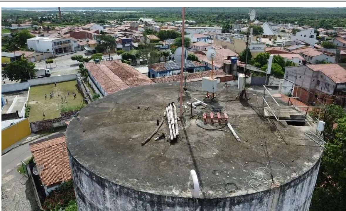
Foto 6 REL-04 (Sede): Pintura desgastada; reservatório sem vedação (tampa deslocada).
