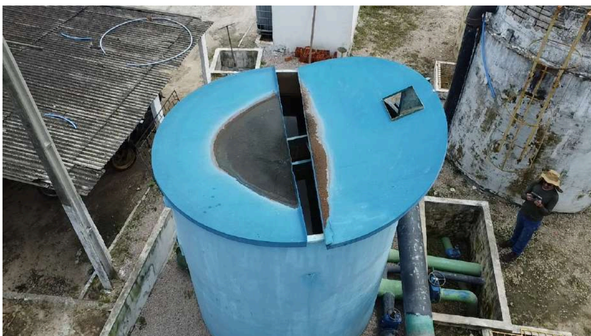
Foto 22 - Filtros (Triângulo): com tampa deslocadas, pintura deteriorada, peças enferrujadas e armação exposta.
