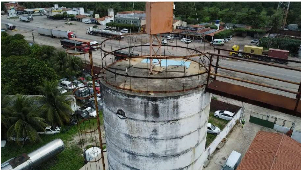
Foto 19 - REL-01 / REL-02 (Triângulo): Armação das pilares dos reservatórios exposta, sem recobrimento, aumentando o processo de depreciação da estrutura e as fragilizando, podendo colocar em risco os operadores e visitantes; passarela de acesso aos reservatórios em acentuada oxidação.
