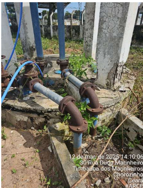
Foto 31 - REL-06 e REL-07 (Timbaúba dos Marinheiros): armadura exposta e com rachaduras; pintura desgastada; fiação inadequada.
