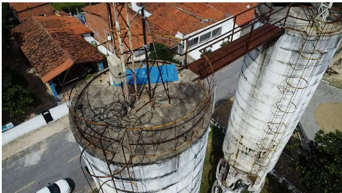
Foto 35 - REL-06 e REL-07 (Timbaúba dos Marinheiros): Ausência de identificação; partes de armadura expostas e com rachaduras; reservatórios com pintura desgastada; passarela de acesso aos reservatórios em acentuada oxidação; escada em estado de oxidação; peças enferrujadas; ausência de tampa; fiação inadequada.
