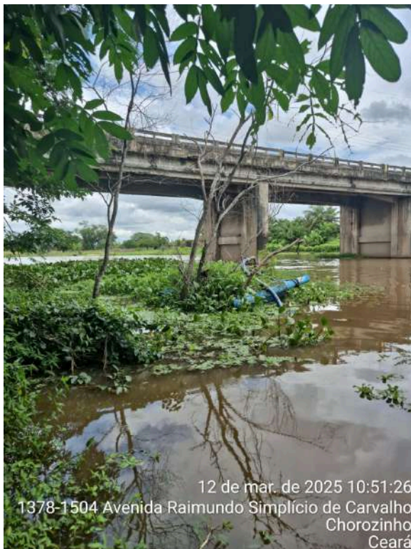
Foto 25 - Captação/RAP-01: flutuante coberto por vegetação.
