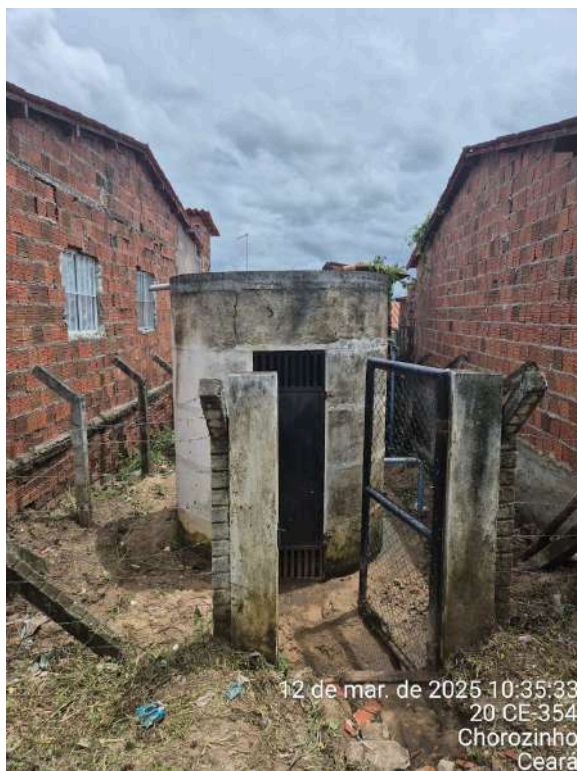
Foto 1 - Booster (Sede): ausência de identificação.
