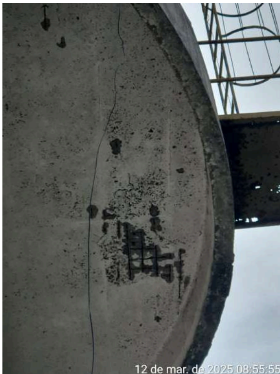
Foto 10 - REL-04 (Sede): armação exposta, principalmente na base do tanque de reservação, e um guarda-corpo oxidado.
