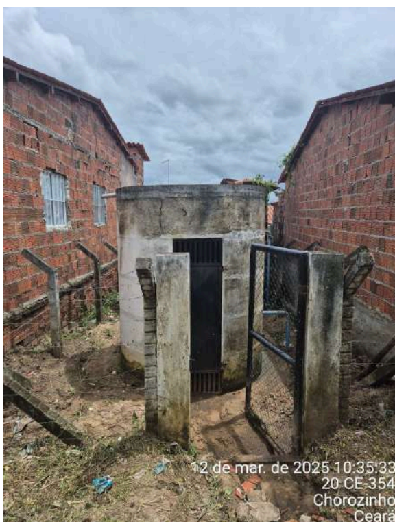
Foto 12 - Booster (Sede): pintura deteriorada; portão danificado, dificultando a entrada.
