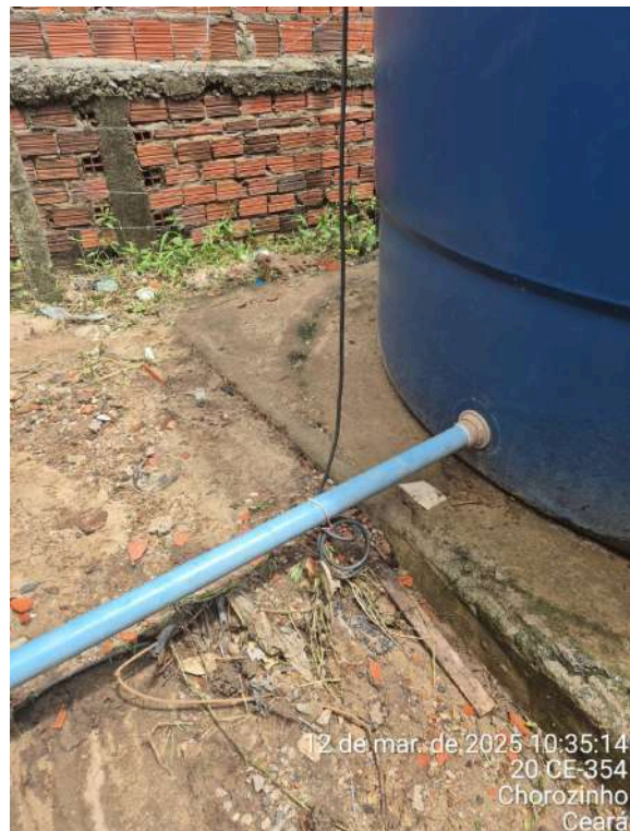
Foto 15 - Booster (Sede): presença de vazamentos.
