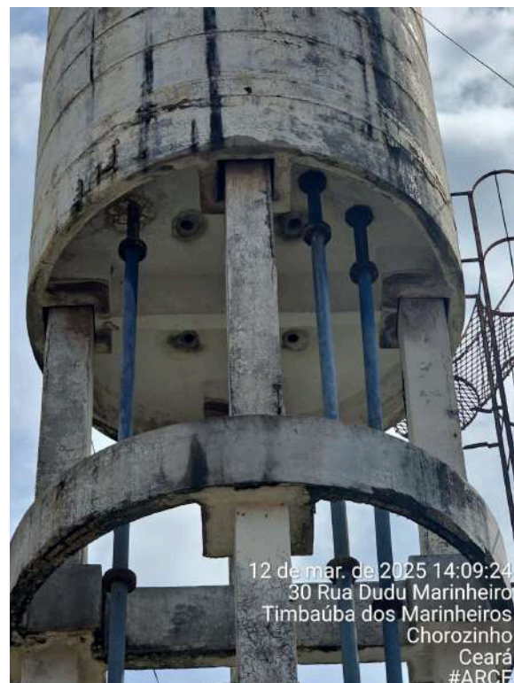
Foto 34 - REL-06 e REL-07 (Timbaúba dos Marinheiros): armadura expostas e com rachaduras; pintura desgastada; escada em estado de oxidação; peças enferrujadas.
