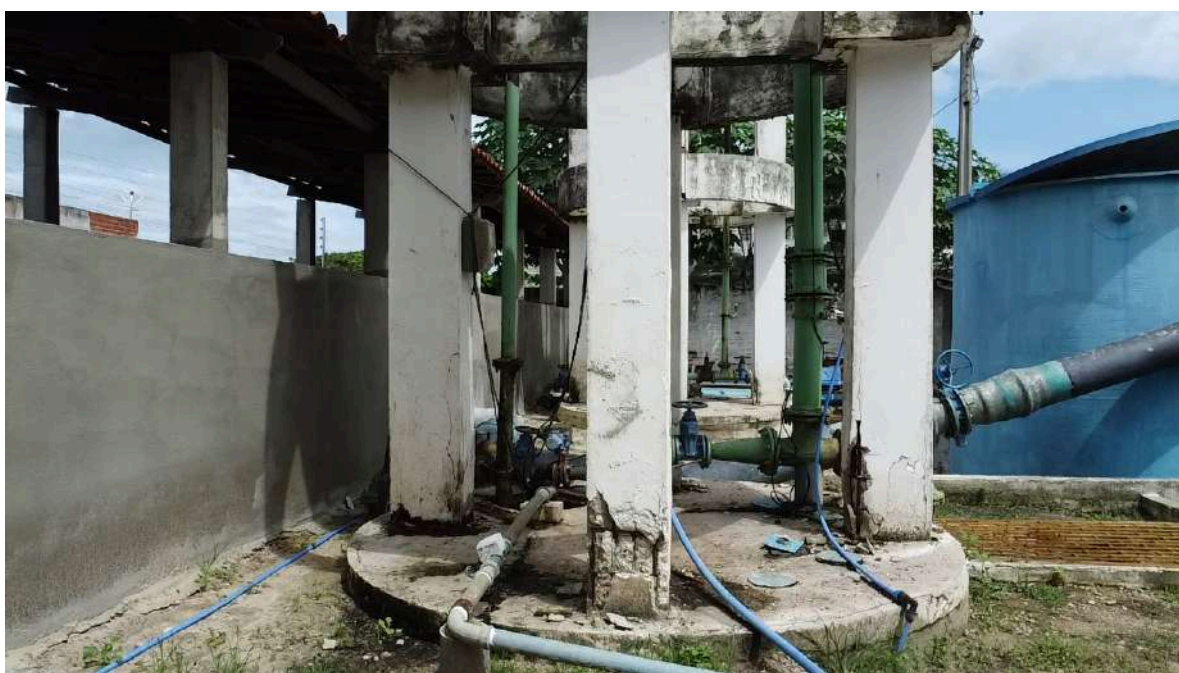
Foto 18 - REL-01 / REL-02 (Triângulo): Armação das pilares dos reservatórios exposta, sem recobrimento, aumentando o processo de depreciação da estrutura e as fragilizando, podendo colocar em risco os operadores e visitantes; passarela de acesso aos reservatórios em acentuada oxidação.
