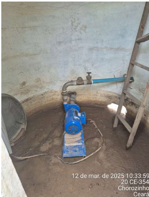
Foto 14 - Booster (Sede): presença de vazamentos.
