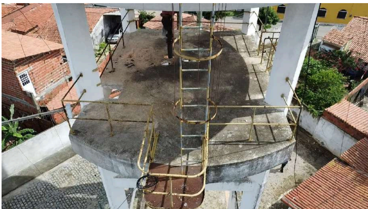
Foto 9 - REL-04 (Sede): escada em avançado estado de oxidação e com pintura desgastada; armação exposta e um guarda-corpo oxidado.
