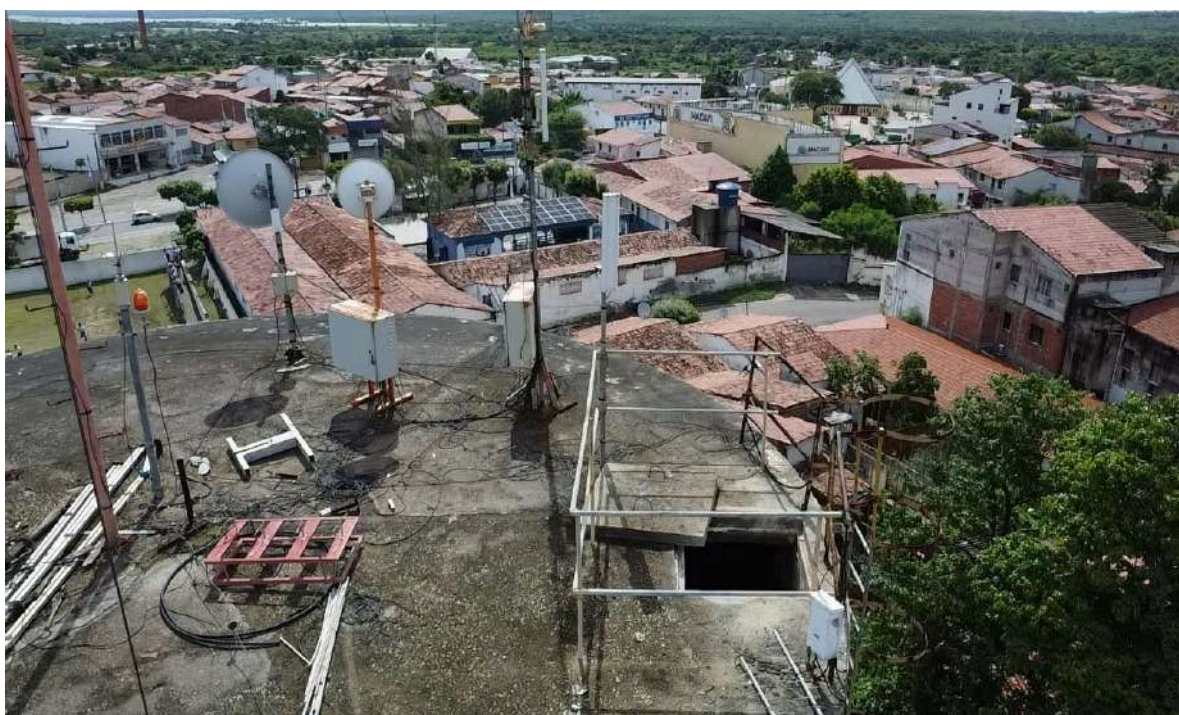
Foto 7 - REL-04 (Sede): reservatório sem vedação (tampa deslocada); cabos/fiação desorganizados e sem eletrodutos na parte superior; presença de materiais/entulho .
