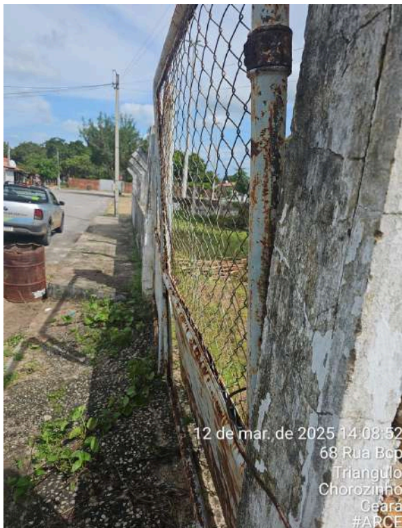
Foto 29 - REL-06 e REL-07 (Timbaúba dos Marinheiros): portão de acesso enferrujado; cercamento inadequado.
