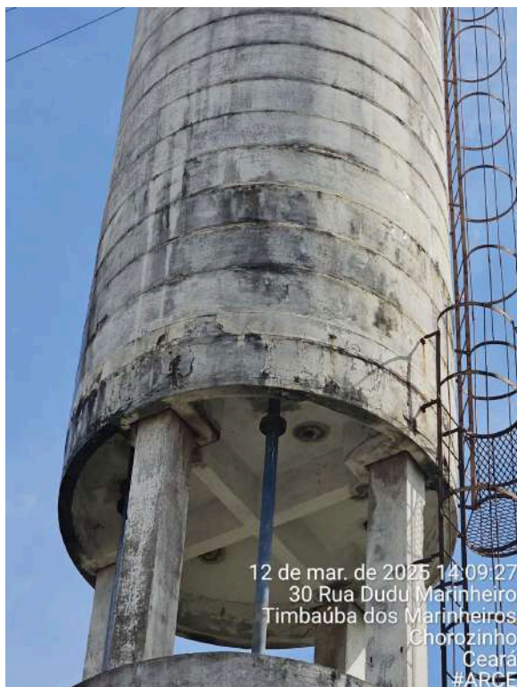
Foto 33 - REL-06 e REL-07 (Timbaúba dos Marinheiros): armadura expostas e com rachaduras; pintura desgastada; escada em estado de oxidação; peças enferrujadas.
