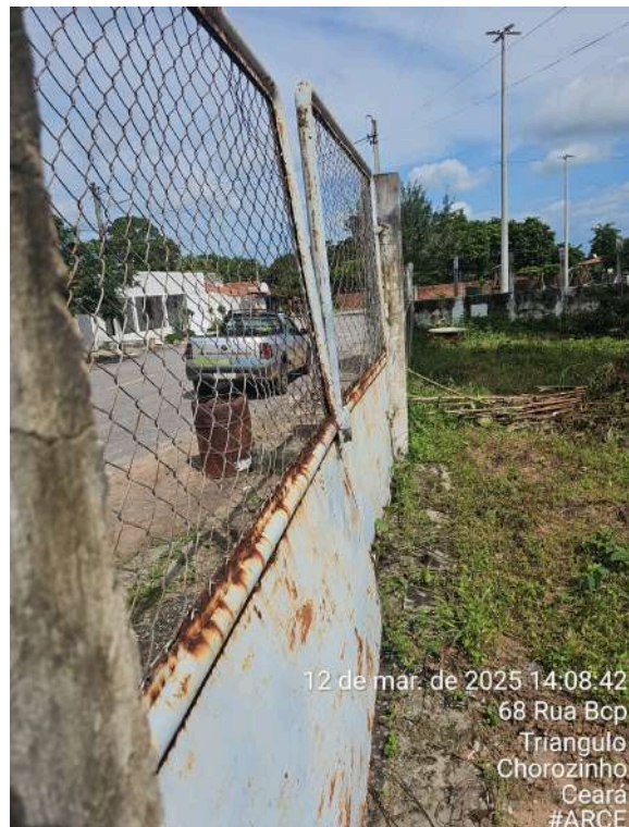
Foto 30 - REL-06 e REL-07 (Timbaúba dos Marinheiros): portão de acesso enferrujado; cercamento inadequado.
