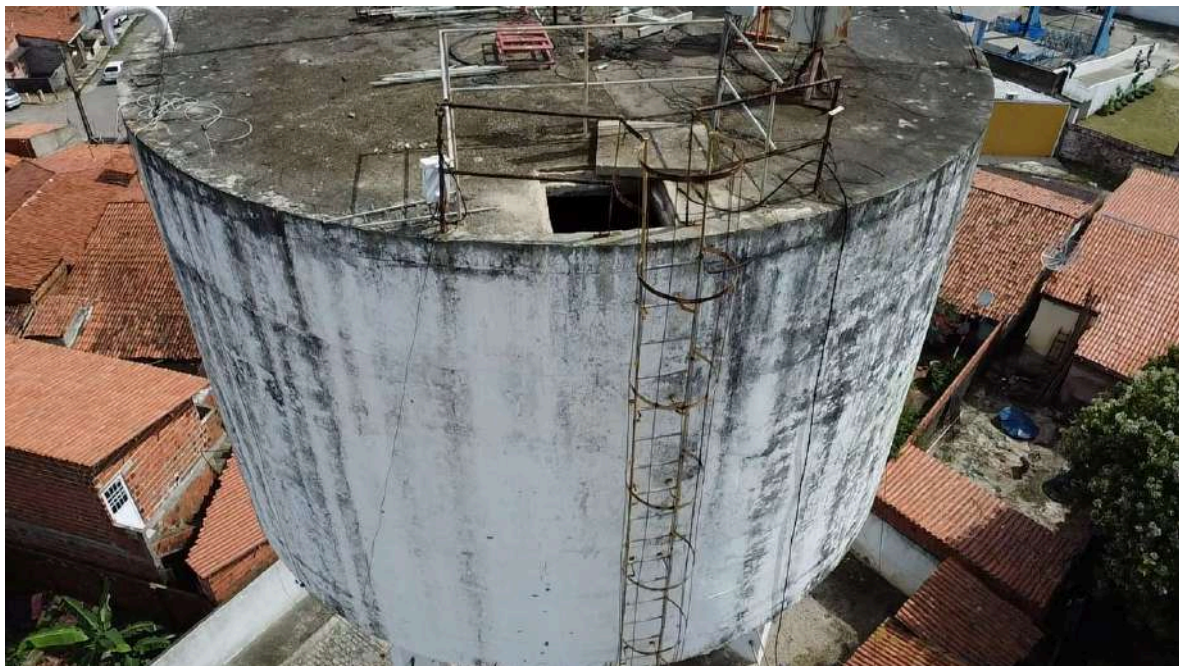
Foto 8 - REL-04 (Sede): escada em avançado estado de oxidação e com pintura desgastada; armação exposta e um guarda-corpo oxidado.
