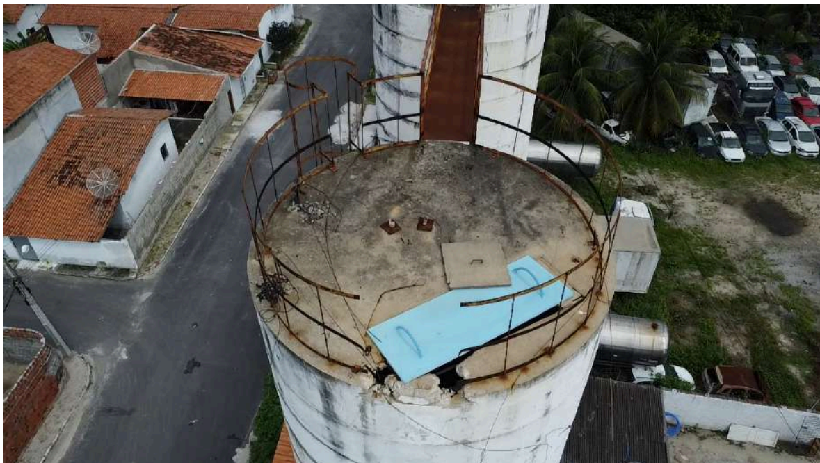
Foto 21 - REL-01 / REL-02 (Triângulo): Armação das pilares dos reservatórios exposta, sem recobrimento, aumentando o processo de depreciação da estrutura e as fragilizando, podendo colocar em risco os operadores e visitantes; passarela de acesso aos reservatórios em acentuada oxidação.
