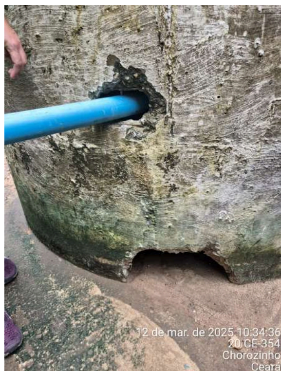
Foto 13 - Booster (Sede): pintura deteriorada e perfuração inadequada.
