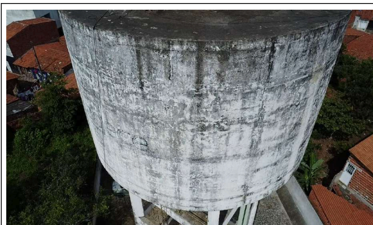
Foto 5 - REL-04 (Sede): Pintura desgastada.
