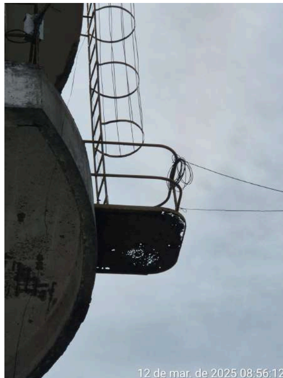
Foto 11 - REL-04 (Sede): armação exposta, principalmente na base do tanque de reservação, e um guarda-corpo oxidado.
