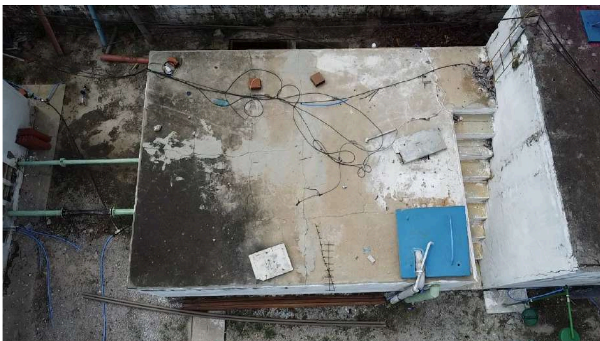
Foto 24 - RAP-02 (Triângulo): com acúmulo de material de construção em local inadequado. Vale ressaltar que há exposição da armadura ao longo de todo o reservatório, inclusive com danos ao tanque de reservação.
