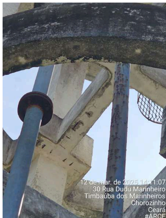
Foto 32 - REL-06 e REL-07 (Timbaúba dos Marinheiros): armadura exposta; pintura desgastada e com rachaduras.
