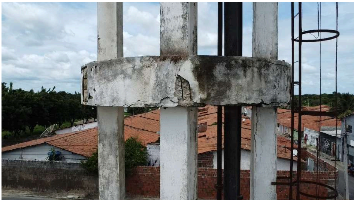
Foto 17 - REL-01 / REL-02 (Triângulo): Armação das pilares dos reservatórios exposta, sem recobrimento, aumentando o processo de depreciação da estrutura e as fragilizando, podendo colocar em risco os operadores e visitantes; passarela de acesso aos reservatórios em acentuada oxidação.
