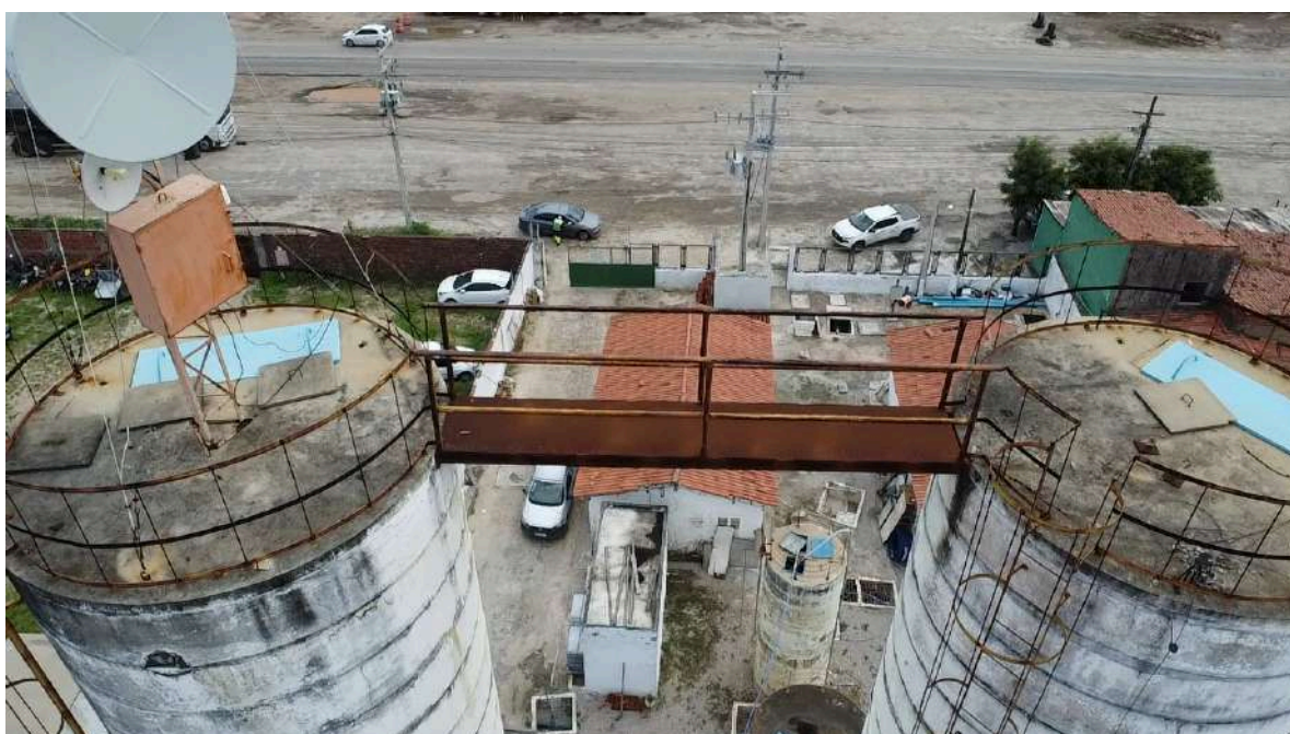
Foto 20 - REL-01 / REL-02 (Triângulo): Armação das pilares dos reservatórios exposta, sem recobrimento, aumentando o processo de depreciação da estrutura e as fragilizando, podendo colocar em risco os operadores e visitantes; passarela de acesso aos reservatórios em acentuada oxidação.
