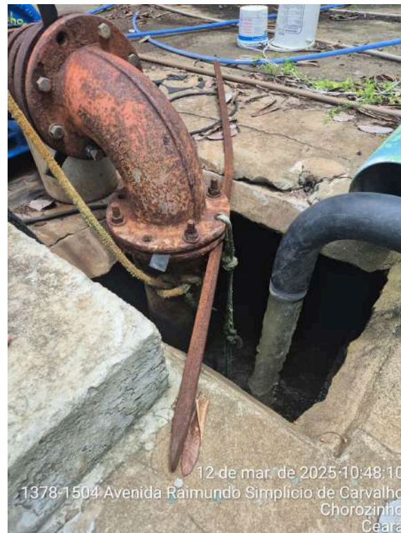
Foto 26 - Captação/RAP-01: peças enferrujadas.
