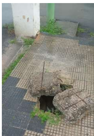
Foto 31 - REL-01: caixa de inspeção com tampa deteriorada.
