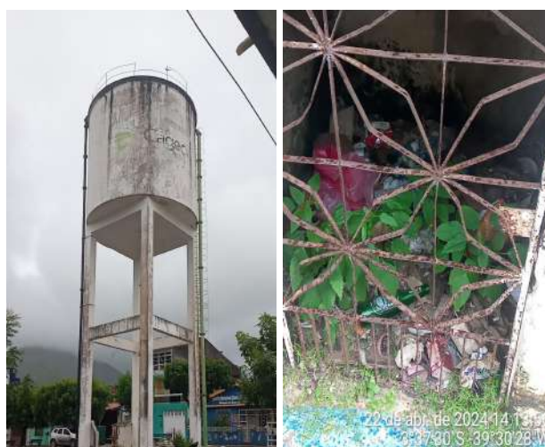
Foto 34 - REL-01: não existe isolamento de proteção da área da base do reservatório e a casa de bombas está inoperante.
