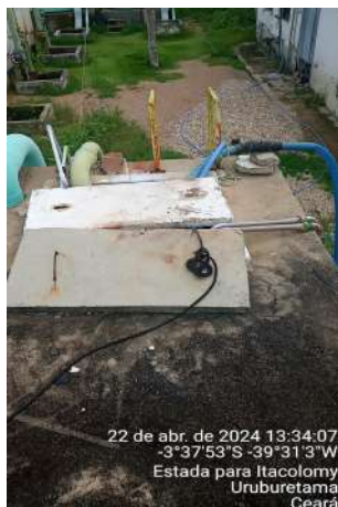
Foto 17 - ETA/RAP-01: tampa sem fechamento hermético.
