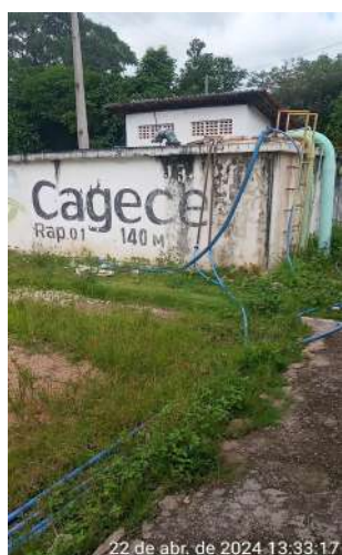
Foto 33 - RAP-01: reservatório sem guarda-corpo de proteção da laje.
