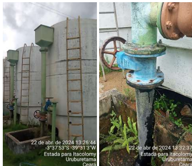
Foto 4 - ETA/Filtros: caixas de inspeção sem tampas e filtros F-01 e F-04 não possuem tampas.
