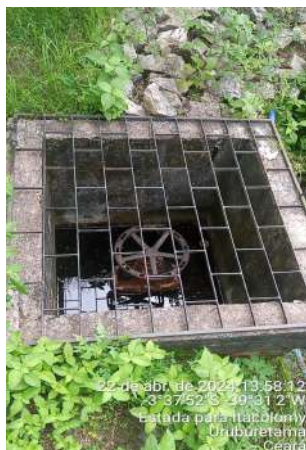
Foto 29 - ETA / Adutoras (Uruburetama e Tururu: infraestrutura e instalações precárias, com caixas de proteção danificadas e com água acumulada e vegetação crescida.
