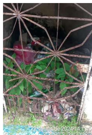
Foto 32 - REL-01: casa de bomba antiga servindo como depósito de lixo.
