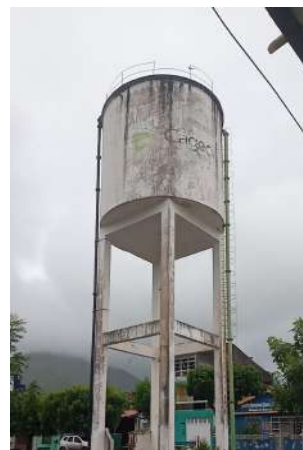
Foto 30 - REL-01: pintura deteriorada e sem identificação visível.
