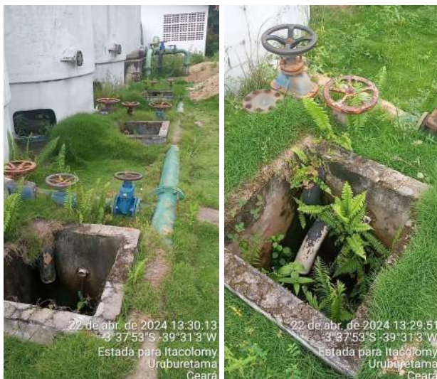
Foto 3 - ETA/Filtros: caixas de inspeção sem tampas e filtros F-01 e F-04 não possuem tampas.
