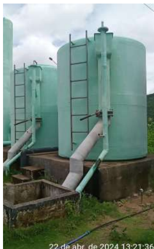
Foto 11 - ETA/Filtros: infraestruturas sem identificação visível; F1 a F6 com escadas tipo marinheiro inadequadas, sem guarda-corpo acima do patamar superior da estrutura e sem gaiola de proteção.
