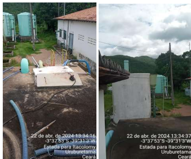
Foto 6 - ETA/RAP-01: fiação elétrica sem eletroduto de isolamento e proteção sobre a laje; fiação elétrica aérea baixa.
