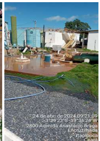
Foto 18 - ETA-02/REN-01 (Sede): reservatório não tem controle de nível e água transborda, inundando e lavando a laje de cobertura, cuja água retorna para dentro do mesmo, por meio de abertura de inspeção, cuja chaminé está quebrada; tubulação por sobre a laje de cobertura.
