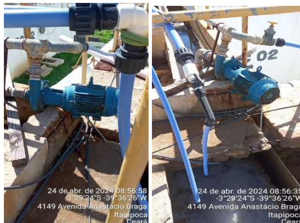
Foto 156 - ETA-02 (Sede): conjunto motor-bomba instalado a céu aberto.
