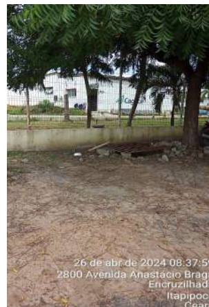
Foto 56 - ETA-02 (Sede): caixas de proteção e inspeção deterioradas (soterradas, inundadas, tomadas por vegetação, quebradas e com tampas danificadas).
