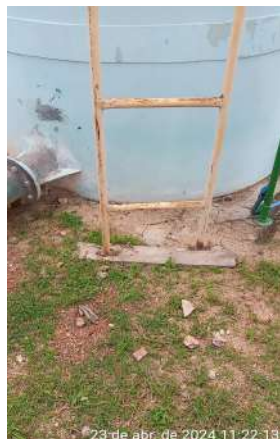
Foto 139 - F-02 (Lagoa da Cruz): apresenta vazamento (registro sem vedação).
