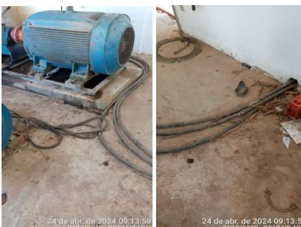
Foto 66 - EEAT-03 (ETA-02) (Sede): instalações elétricas inadequadas sobre o piso, através do vão da porta de entrada, com cabos/fiação elétricos sem eletrodutos ou calhas de isolamento e proteção.
