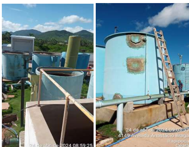
Foto 63 - F-09 a F-11 (ETA-02) (Sede): identificação confusa dos filtros F-09 e F-10 e filtros com pinturas desgastadas.
