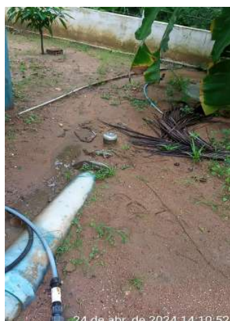
Foto 163 - ETA (Deserto): a área externa da estação de tratamento não é pavimentada.
