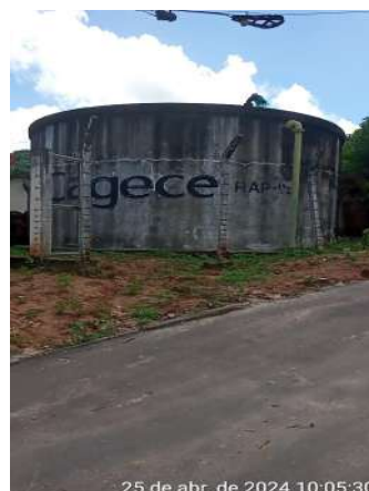
Foto 84 - RAP-05 (Sede): pintura deteriorada; identificação desgastada e cerca danificada.
