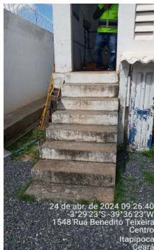
Foto 19 - ETA-02 / Cloração (Sede): escadaria de acesso sem corrimãos.
