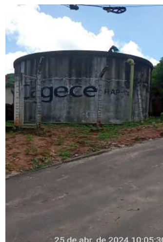
Foto 24 - RAP-05 (Sede): não tem escada tipo marinheiro e sem iluminação.
