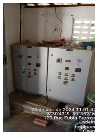
Foto 90 - EEAT-02 (ETA-01) (Sede): quadro de comando apoiado sobre tijolos.
