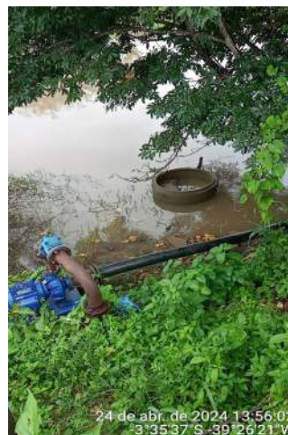
Foto 158 - Captação (Deserto): Conjunto motor-bomba instalado a céu aberto
