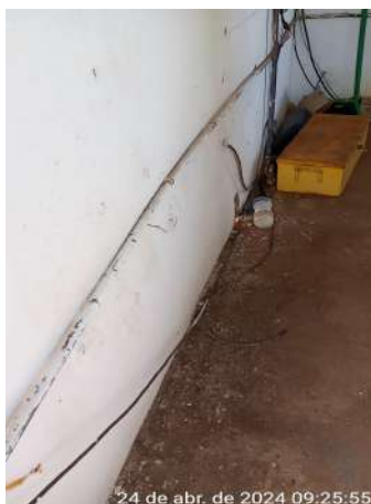
Foto 71 - ETA-02/Cloração (Sede): instalações elétricas precárias sem eletrodutos ou eletrodutos danificados.
