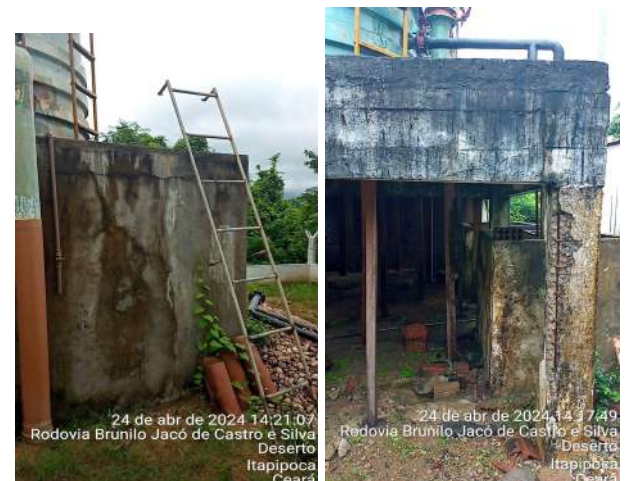
Foto 124 ETA/Filtros (Deserto): infraestrutura da plataforma de apoio em estado de deterioração total, com risco de desabamento e escada de acesso aos filtros inadequada.
