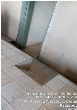
Foto 159 - Mini Laboratório da ETA-02 (Sede): possui batente alto sem grade de proteção na sala do quadro de comando.
