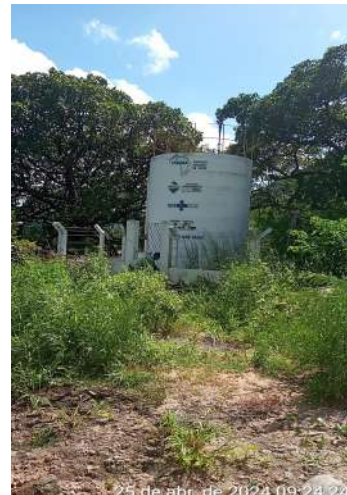
Foto 28 - RAP's Estrada da Serrinha (Sede): reservatório sem identificação
