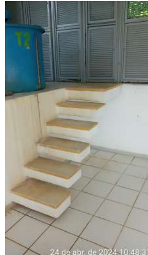
Foto 26 - ETA-01 / Casa de Química (Sede): escadaria sem corrimão.
