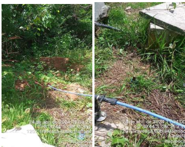
Foto 87 - REL-01 (ETA-01) (Sede): área do reservatório tomada pela vegetação; instalações elétricas precárias, sem eletrodutos de isolamento e proteção.
