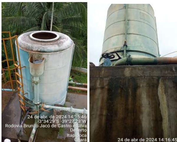
Foto 123 ETA/Filtros (Deserto): filtros com pintura e identificação desgastados e escada de acesso aos filtros inadequada.
