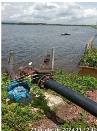
Foto 155 - Captação (Lagoa da Cruz): conjuntos motor-bomba instalado a céu aberto.
