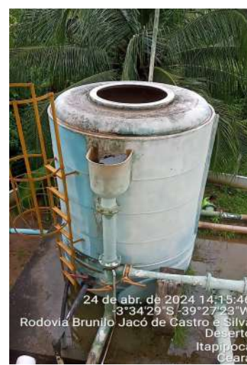
Foto 34 ETA / Filtro (Deserto): sem tampas.
