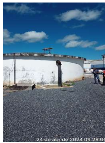
Foto 72 - RSE-01 (ETA-02) (Sede): pintura desgastada.
