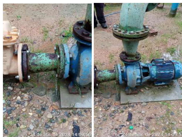
Foto 164 - ETA (Deserto): conjunto moto bomba de lavagem dos filtros funciona a céu aberto
