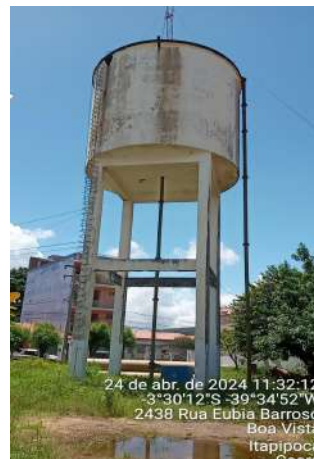
Foto 160 - REL-Sem denominação (Sede): reservatório desativado, porém não foi realizado o desmonte completo das infraestruturas.
