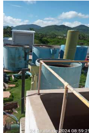
Foto 14 - ETA-02 / Filtros F-09 a F-11 (Sede): filtros sem tampas.
