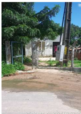
Foto 107 - RAP-04/EEAT-04 (Sede): portão de entrada emperrado (não fecha); vegetação crescida, estruturas com pintura e identificação desgastadas.
