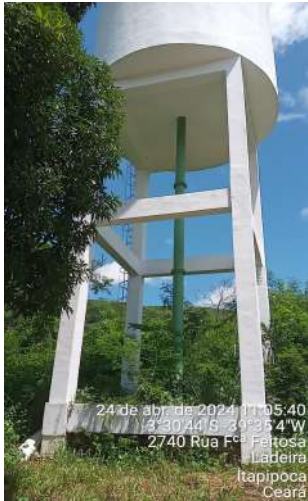
Foto 25 - ETA-01 / REL-01 (Sede): sem identificação.
