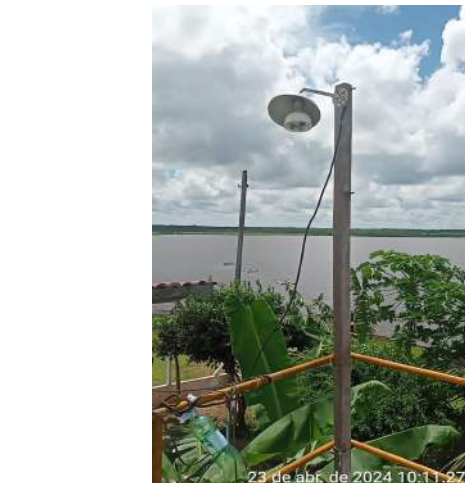
Foto 45 - RAP-06 (Sede): fiação inadequada com fios soltos e/ou enrolados na grade de proteção e lâmpada danificada.
