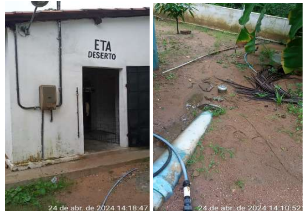
Foto 122 ETA/Pátio Externo (Deserto): tubulações expostas sobre o solo na área de circulação.
