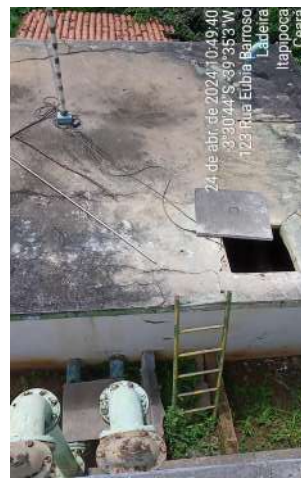
Foto 88 - RAP-01 (ETA-01) (Sede): fios/cabos elétricos por sobre a laje do reservatório; tampa de inspeção sem fechamento hermético; escada tipo marinheiro solta e inadequada sem guarda-corpo acima do patamar superior da estrutura e sem gaiola de proteção.
