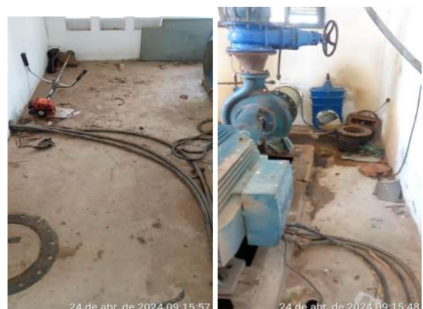
Foto 65 - EEAT-03 (ETA-02) (Sede): área suja e com material armazenado indevidamente no local; instalações elétricas inadequadas sobre o piso.
