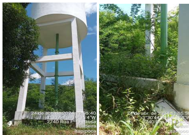
Foto 86 - REL-01 (ETA-01) (Sede): área do reservatório tomada pela vegetação; instalações elétricas precárias, sem eletrodutos de isolamento e proteção.
