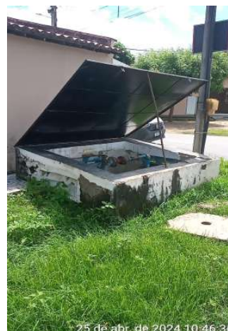
Foto 112 EERD-01 (Sede): reboco e pintura deteriorados; caixas de inspeção danificadas e cobertas por vegetação.
