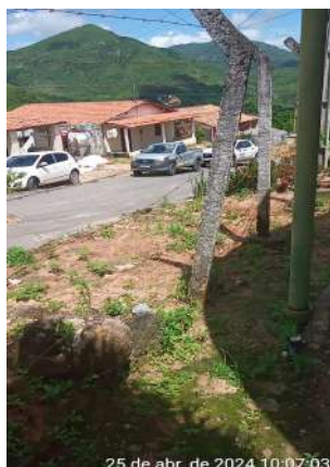
Foto 85 - RAP-05 (Sede): cerca danificada.
