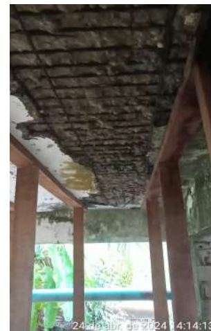
Foto 126 ETA/Filtros (Deserto): infraestrutura da plataforma de apoio em estado de deterioração total, com risco de desabamento.
