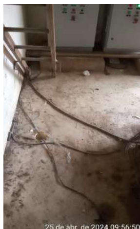
Foto 111 RAP-04 / EEAT-04 (Sede): ambiente sujo da casa de bombas; instalações elétricas precárias com fiação/cabos soltos sobre o piso e RAP-04 sem escada apropriada.
