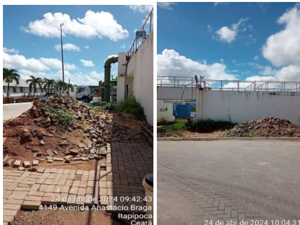
Foto 61 - ETA-02 (Sede): vegetação crescida próxima aos filtros e decantadores, calçada deteriorada e acúmulo de entulho próximo aos floculadores e decantadores.
