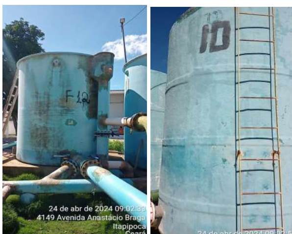
Foto 64 - F-09 a F-11 (ETA-02) (Sede): identificação confusa dos filtros F-09 e F-10 e filtros com pinturas desgastadas .
