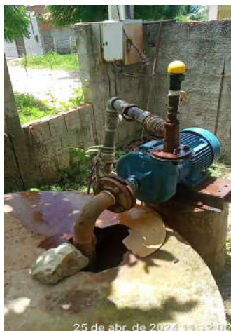
Foto 157 - EERD-03 (Sede): Conjunto motor-bomba instalado a céu aberto
