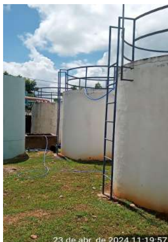
Foto 39 - ETA/RAP's (Lagoa da Cruz): sem identificação e escadas tipo marinheiro sem gaiola de proteção.
