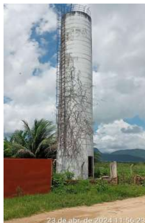
Foto 147 - REL-01 (Lagoa da Cruz): pintura e identificação desgastados, escada e grade de proteção em processo de corrosão; área com vegetação crescida e escada tomada por planta não há iluminação para trabalhos noturnos.
