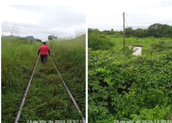
Foto 121 Manancial/Captação (Deserto): Acesso difícil, impedido pelo mato e pela lama, tendo os operadores que se arriscar a ir pelos trilhos da ferrovia.
