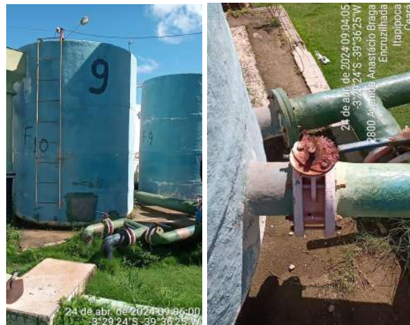
Foto 62 - F-09 a F-11 (ETA-02): identificação confusa dos filtros F-09 e F-10 e F-10 com volante do registro danificado.
