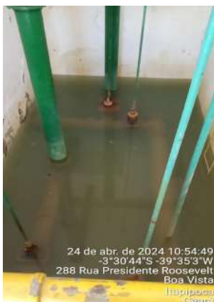
Foto 93 - ETA-01 (Sede): caixa de registros inundada.
