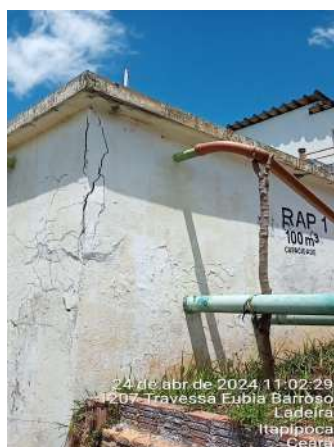
Foto 89 - RAP-01 (ETA-01) (Sede): pintura desgastada; rachadura, tubulação com escora improvisada por galho.
