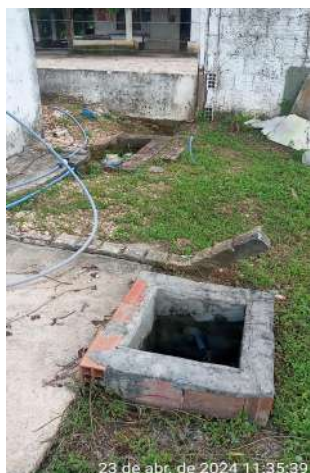
Foto 41 - ETA / Macromedicação e outros (Lagoa da Cruz): instalação de macromedicação sem caixa e caixa sem tampa.
