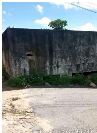
Foto 161 - RAP-02 está desativado e a infraestrutura encontra-se abandonada.
