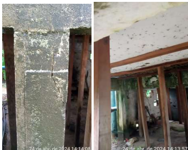
Foto 125 ETA/Filtros (Deserto): infraestrutura da plataforma de apoio em estado de deterioração total, com risco de desabamento.
