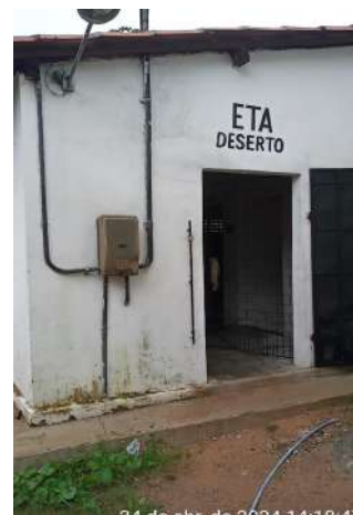
Foto 162 - ETA (Deserto): a área externa da estação de tratamento não é pavimentada.
