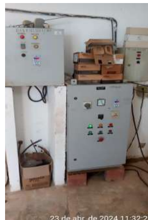
Foto 134 ETA/Casa de Bomba (Lagoa da Cruz): instalações elétricas precárias com quadro de comando apoiado sobre tijolos, fios/cabos sem eletrodutos de isolamento e proteção.
