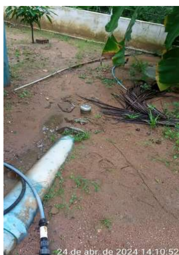
Foto 33 ETA / Pátio externo (Deserto): macromedidor sem caixa de proteção.
