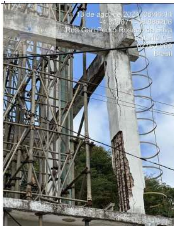
Foto 28 - REL-01: apesar de desativado, apresenta estrutura comprometida com risco aos operadores.
