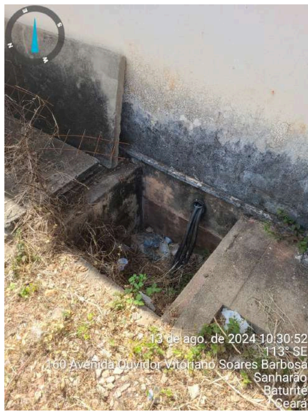
Foto 8 - RAP-04 e EEAT-05: caixas de inspeção sem tampas.
