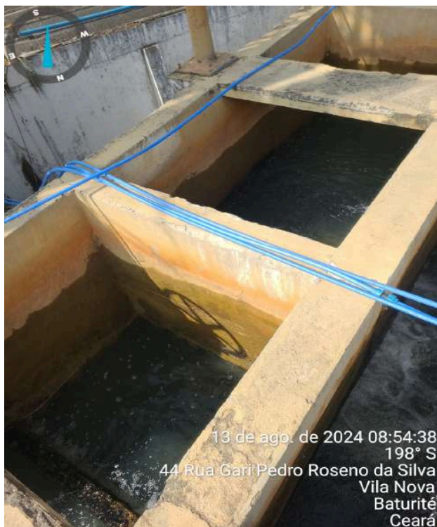
Foto 15 - Filtros F-02 / F-03 / F-04: vazões de produção distribuídas irregularmente devido aos fluxos irregulares dos decantadores e vazamentos nos filtros com grande quantidade de água tratada perdida.
