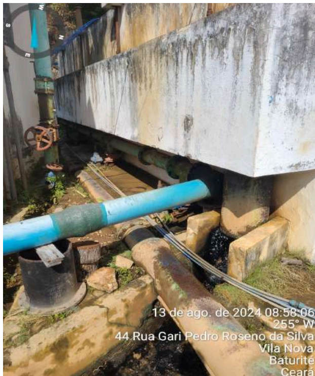
Foto 17 - Filtros F-02 / F-03 / F-04: vazões de produção distribuídas irregularmente devido aos fluxos irregulares dos decantadores e vazamentos nos filtros com grande quantidade de água tratada perdida.
