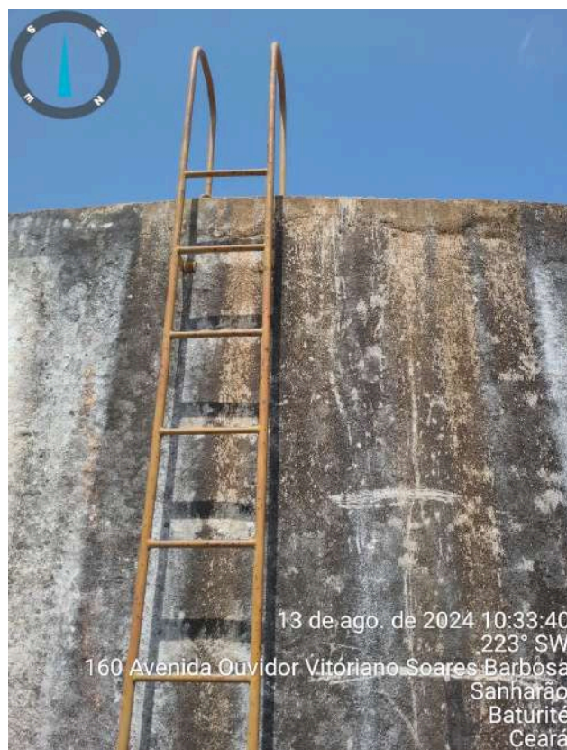
Foto 30 - RAP-04 / EEAT-05: escada corroída e pintura deteriorada.
