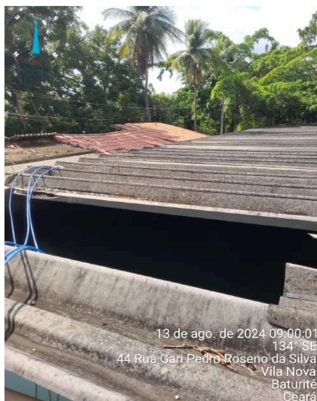
Foto 21 - RAP-01 / RAP-02: cobertura formada por telhados em cimento de amianto quebrados, sujeitando a água tratada a intempéries.
