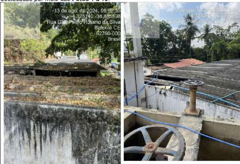
Fotos 1 e 2 - Reservatórios de água tratada sem proteção e submetidos a todos os tipos de intempéries.
