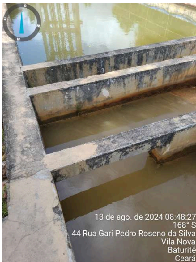
Foto 7 - Decantadores / Flocculadores / Filtros: ausência de guarda-corpos.
