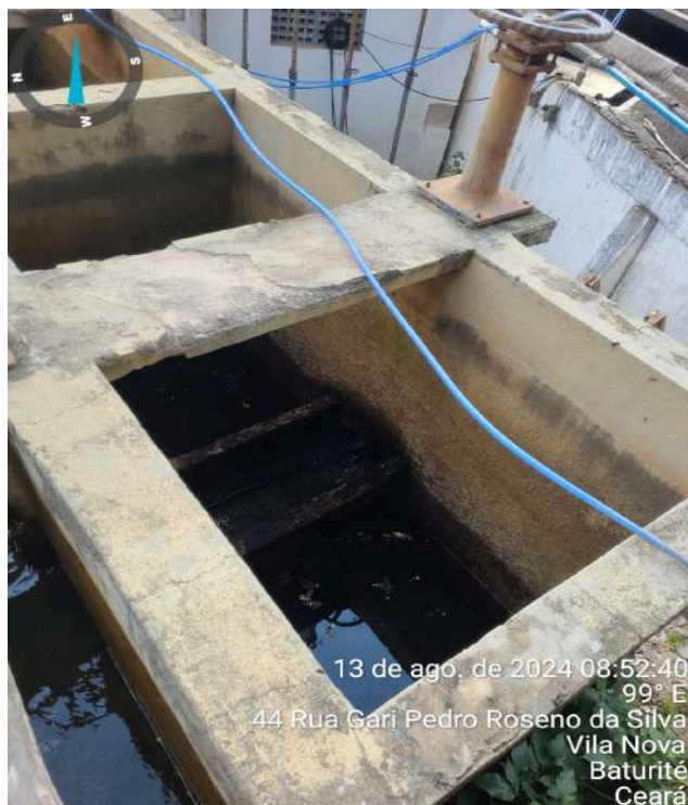
Foto 31 - Filtro F-01: inoperante.
