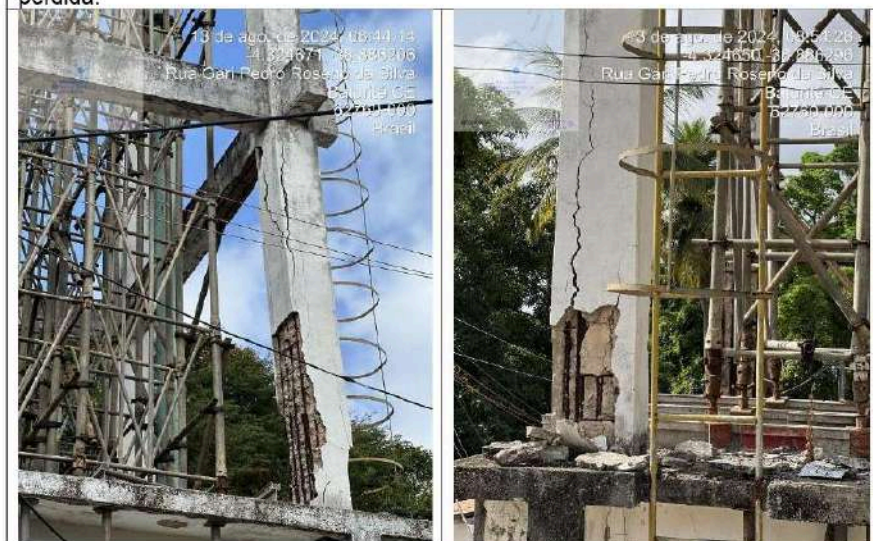
Fotos 5 e 6 – Reservatório com estrutura comprometida.
