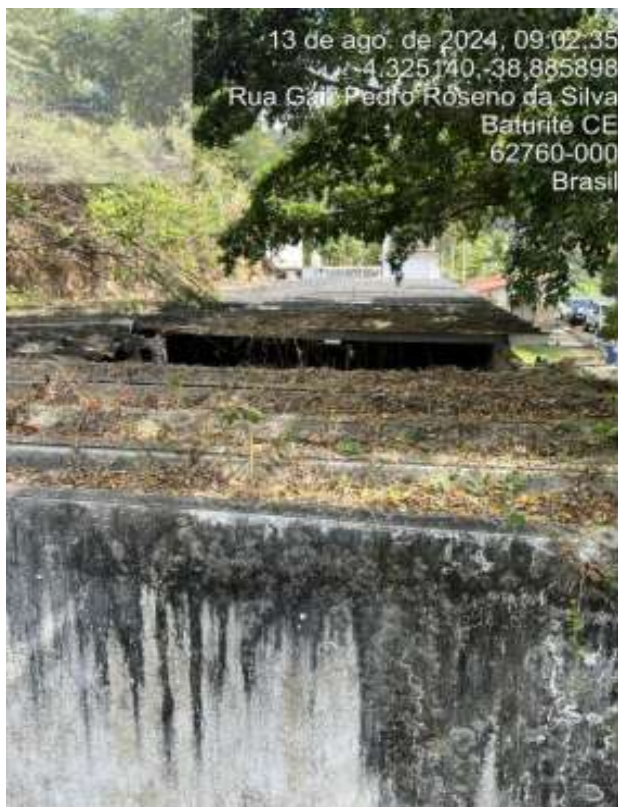
Foto 19 - RAP-01 / RAP-02: cobertura formada por telhados em cimento de amianto quebrados, sujeitando a água tratada a intempéries.
