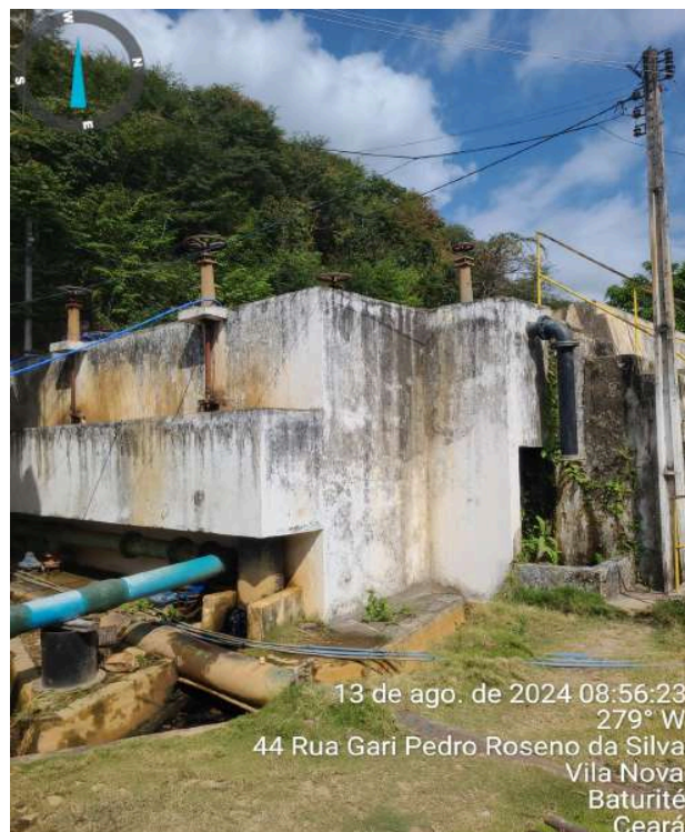
Foto 16 - Filtros F-02 / F-03 / F-04: vazões de produção distribuídas irregularmente devido aos fluxos irregulares dos decantadores e vazamentos nos filtros com grande quantidade de água tratada perdida.
