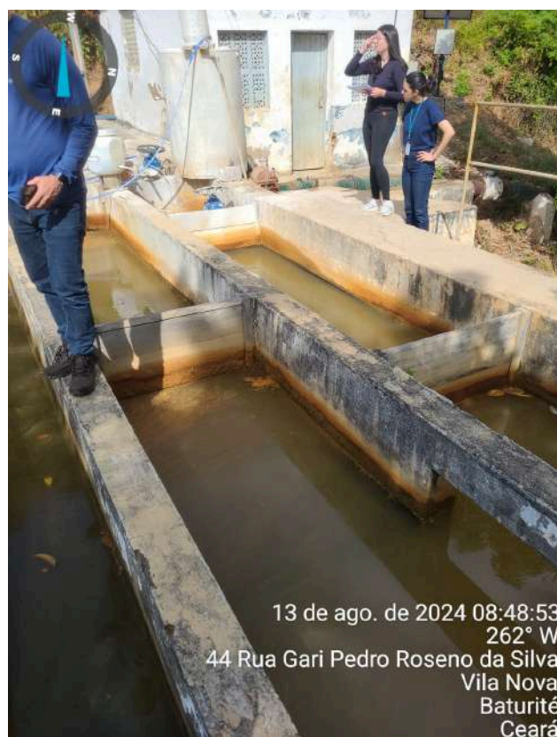
Foto 2 - Decantadores / Floculadores / Filtros: ausência de guarda-corpos.
