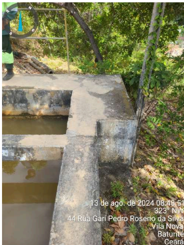
Foto 5 - Decantadores / Flocculadores / Filtros: ausência de guarda-corpos.
