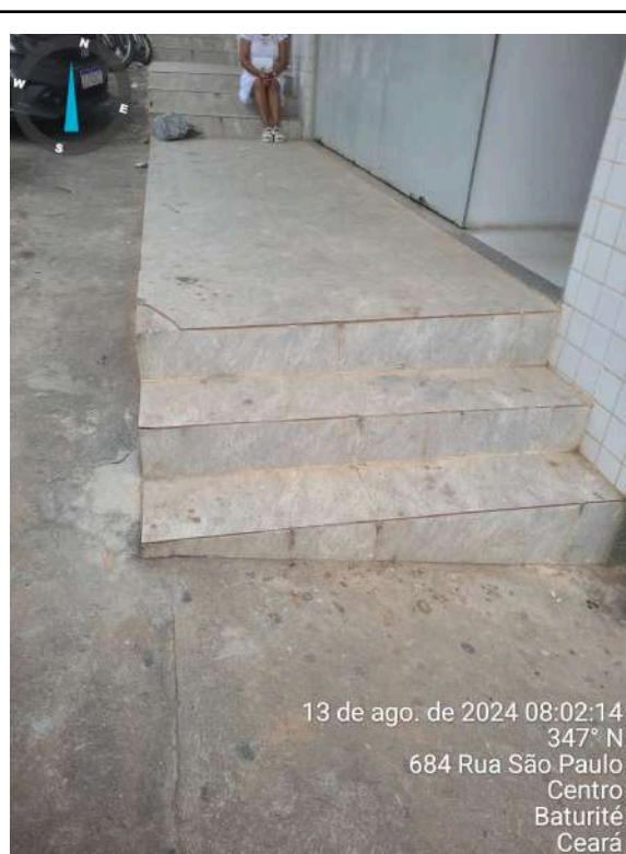
Foto 37 - O Escritório da CAGECE não possui acessibilidade adequada para cadeirantes.
