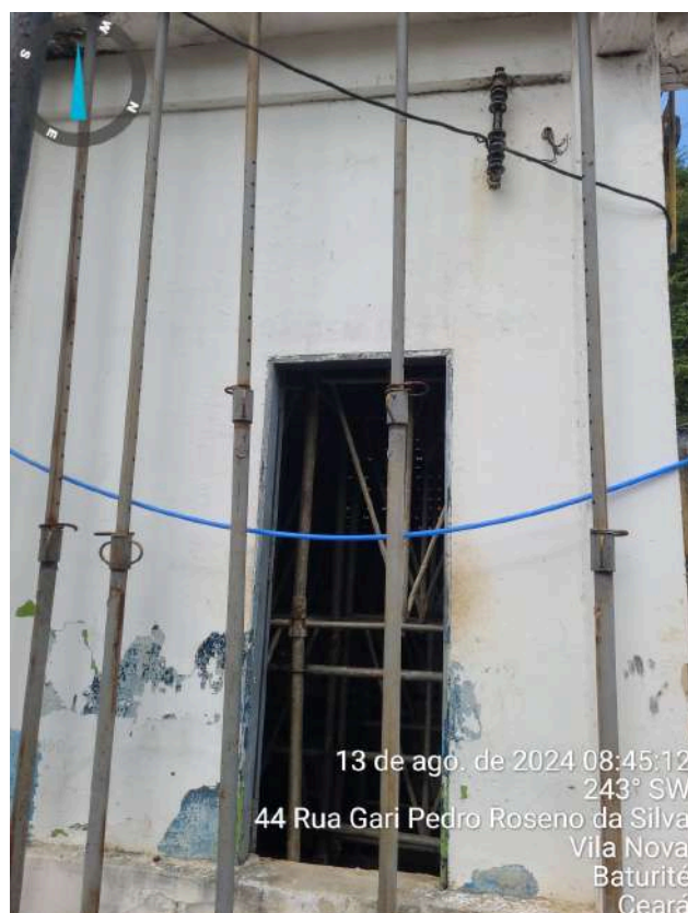
Foto 26 - REL-01: apesar de desativado, apresenta estrutura comprometida com risco aos operadores.
