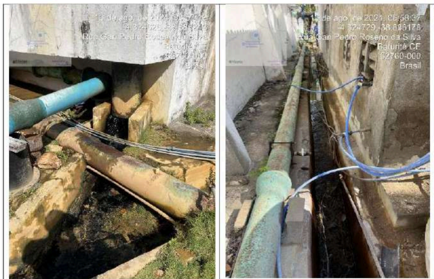
Fotos 3 e 4 – Vazamentos nos filtros com grande quantidade de água tratada perdida.
