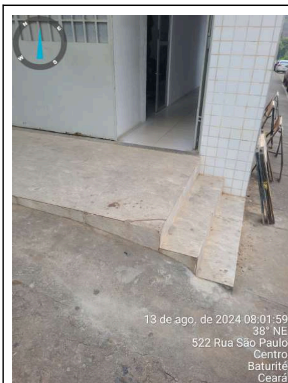
Foto 36 - O Escritório da CAGECE não possui acessibilidade adequada para cadeirantes.
