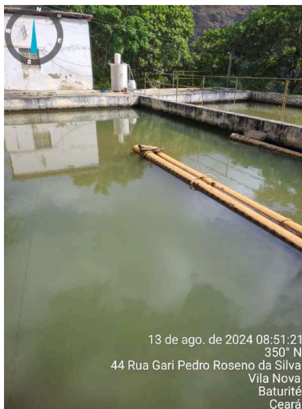
Foto 13 - ETA: tubulações de transferência de fluxo dos decantadores aos filtros improvisados e desnivelados, acarretando diferentes tempos de detenção hidráulica e fluxos preferenciais nos processos de decantação e filtração.
