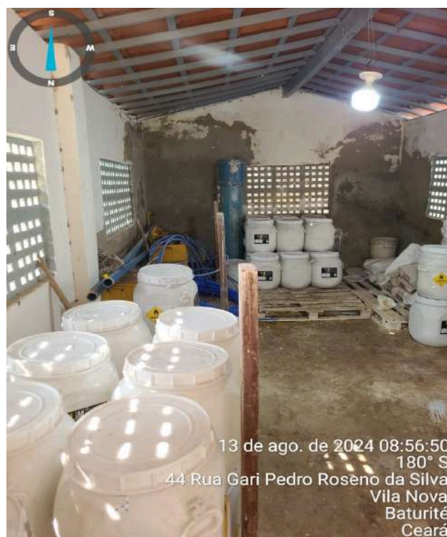
Foto 24 - Depósito de produtos químicos: pintura deteriorada.
