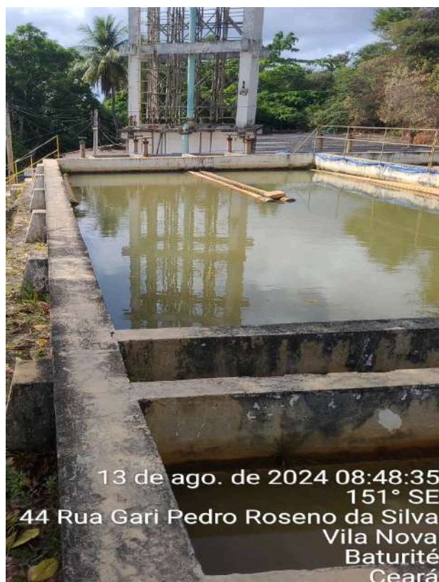
Foto 14 - ETA: tubulações de transferência de fluxo dos decantadores aos filtros improvisados e desnivelados, acarretando diferentes tempos de detenção hidráulica e fluxos preferenciais nos processos de decantação e filtração.
