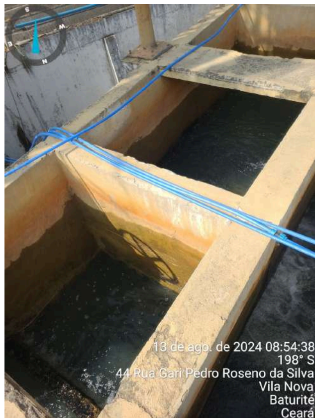
Foto 6 - Decantadores / Flocculadores / Filtros: ausência de guarda-corpos.
