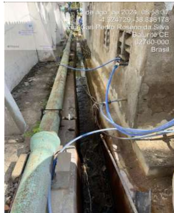
Foto 18 - Filtros F-02 / F-03 / F-04: vazões de produção distribuídas irregularmente devido aos fluxos irregulares dos decantadores e vazamentos nos filtros com grande quantidade de água tratada perdida.
