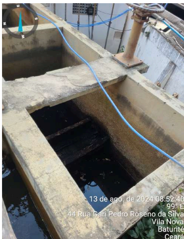
Foto 3 - Decantadores / Floculadores / Filtros: ausência de guarda-corpos.
