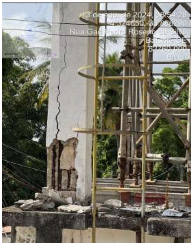
Foto 27 - REL-01: apesar de desativado, apresenta estrutura comprometida com risco aos operadores.
