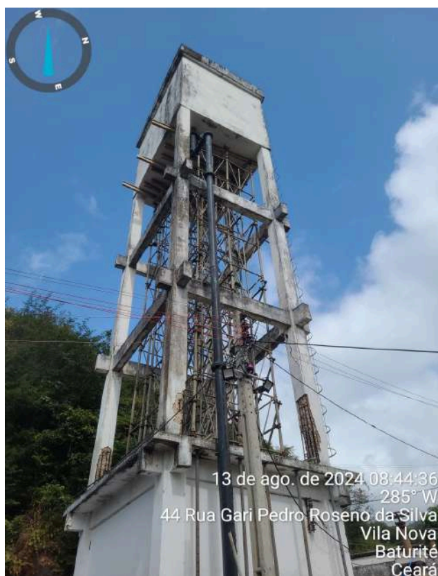
Foto 25 - REL-01: apesar de desativado, apresenta estrutura comprometida com risco aos operadores.
