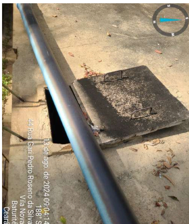
Foto 23 - RAP-03: tampa deslocada.
