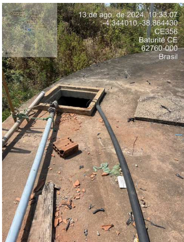
Foto 29 - RAP-04 / EEAT-05: tampa deslocada.
