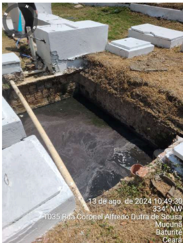
Foto 11 - ETE Proub II: a cobertura do filtro anaeróbio desabou.
