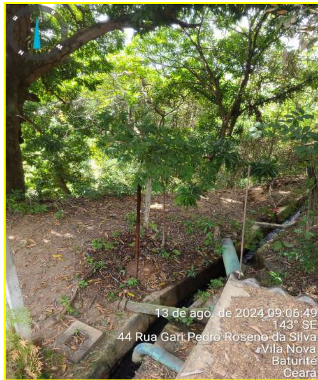
Foto 32 - ETA: ausência de delimitação em alguns pontos da área da estação e presença de vegetação nas estruturas internas.
