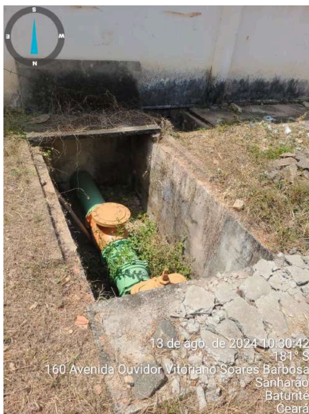
Foto 9 - RAP-04 e EEAT-05: caixas de inspeção sem tampas.
