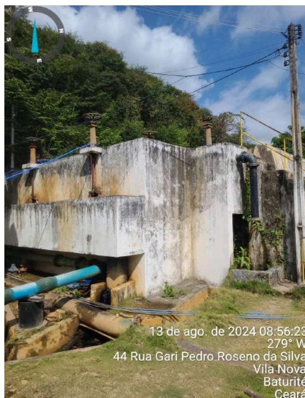
Foto 4 - Decantadores / Floculadores / Filtros: ausência de guarda-corpos.
