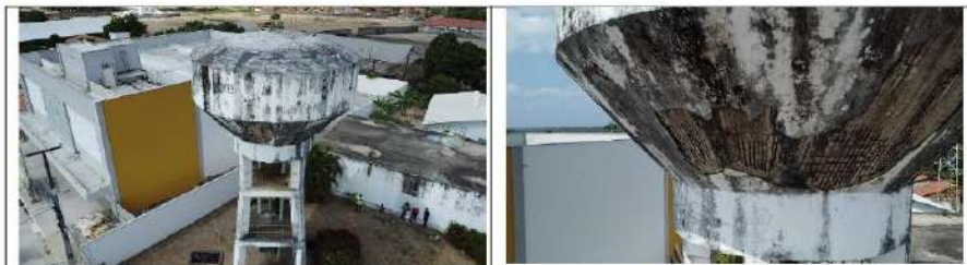
Fotos 3 e 4 – Vista geral das armaduras expostas do reservatório elevado.
