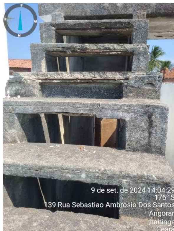
Foto 26 - ETE PROURB II (Angorá): escada com estrutura comprometida e sem guarda-corpo.
