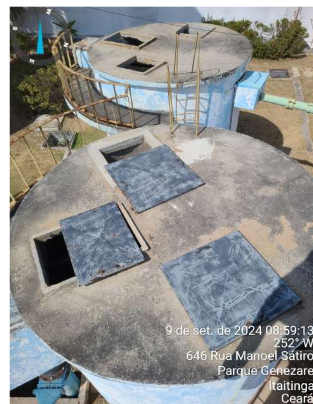
Foto 10 - Filtros F-01 / F-02: sem tampas ou tampas deslocadas.
