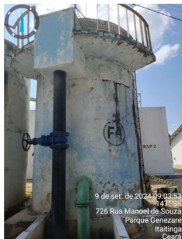
Foto 14 - Filtro F-04: pintura deteriorada e guarda-corpo corroído
