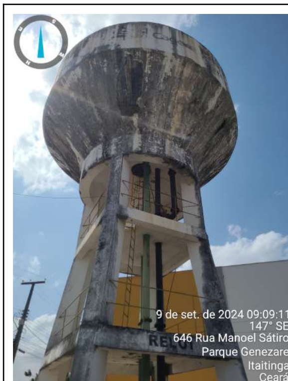
Foto 1 - REL-01: escada e guarda-corpo corroídos, pintura deteriorada e estrutura em concreto armado com aço exposto.
