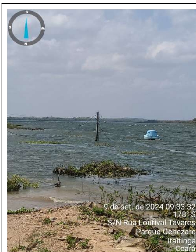
Foto 5 - Captação: cabos elétricos energizados dos postes submersos.
