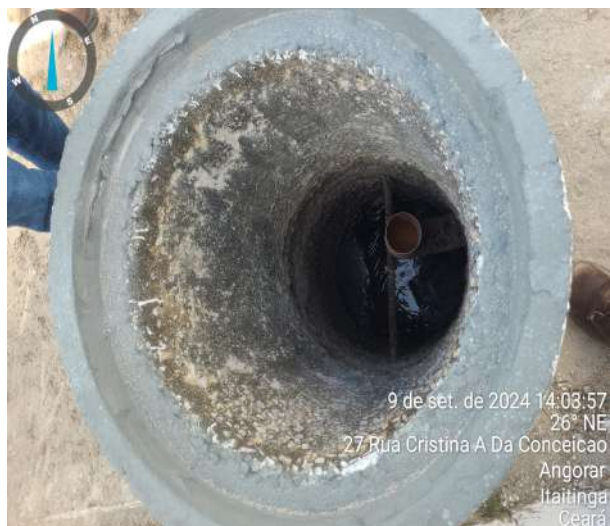
Foto 23 - ETE PROURB II (Angorá): Estação com poços sem tampas.
