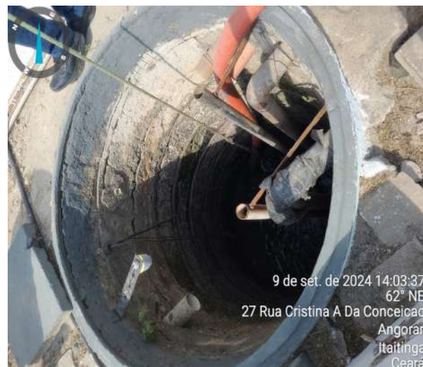
Foto 24 - ETE PROURB II (Angorá): Estação com poços sem tampas.
