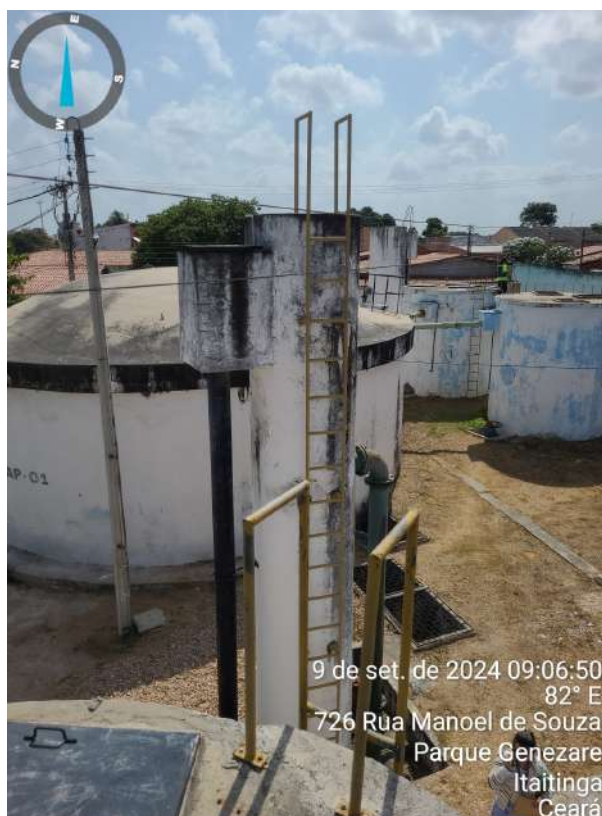
Foto 17 - RAP-01: pintura deteriorada e escada corroída.
