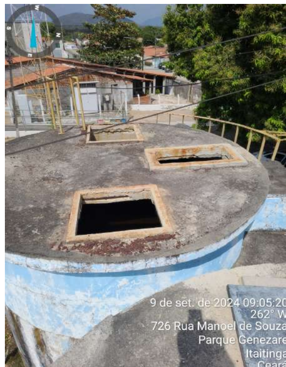
Foto 16 - Filtro F-04: pintura deteriorada, sem tampas e guarda-corpo corroído.
