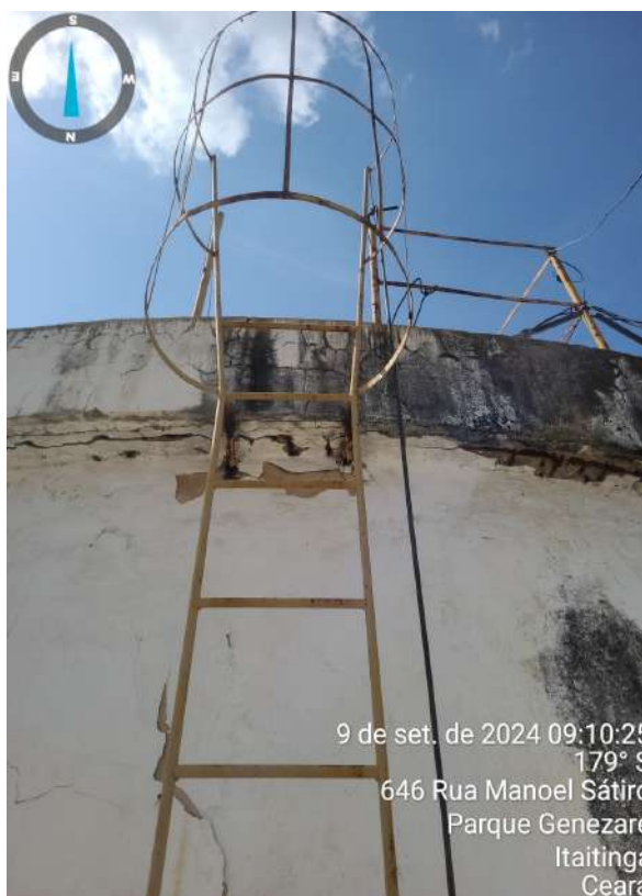
Foto 18 - RAP-01: pintura deteriorada e escada corroída.
