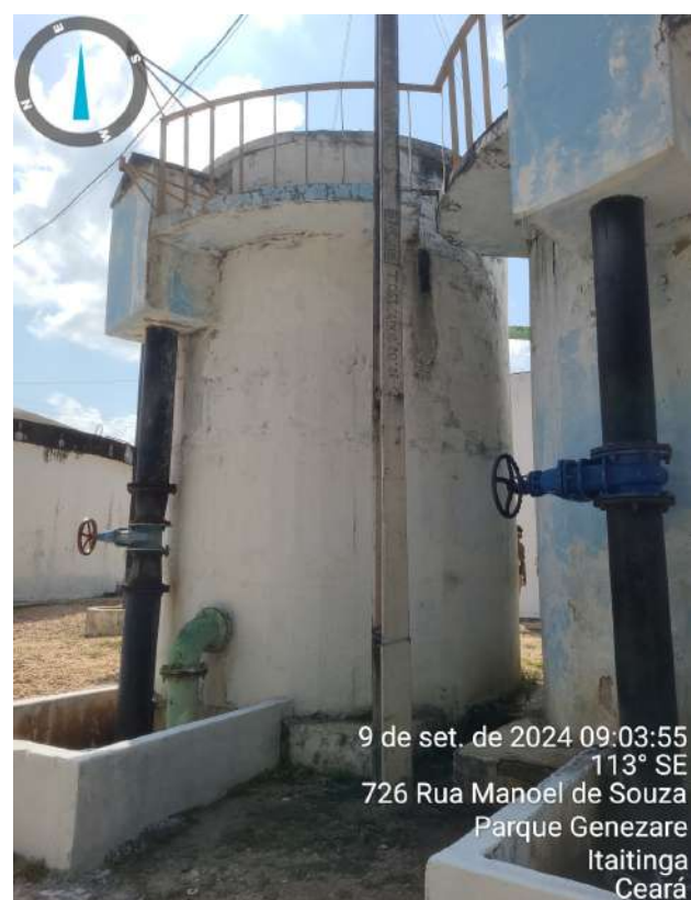
Foto 13 - Filtro F-03: pintura deteriorada e guarda-corpo corroído.
