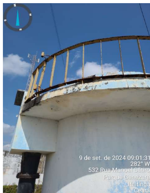
Foto 9 - Filtros F-01: pintura deteriorada e guarda-corpo corroído.
