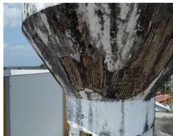
Foto 4 - REL-01: escada e guarda-corpo corroídos, pintura deteriorada e estrutura em concreto armado com aço exposto.
