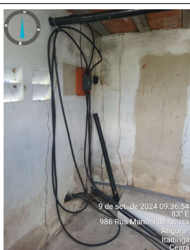
Foto 6 - EECS-1: instalações elétricas inadequadas.
