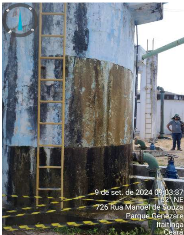
Foto 15 - Filtro F-04: pintura deteriorada e presença de vazamento.
