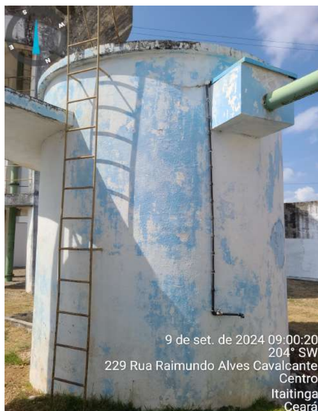
Foto 11 - Filtros F-01 / F-02: pintura deteriorada e escada corroída.
