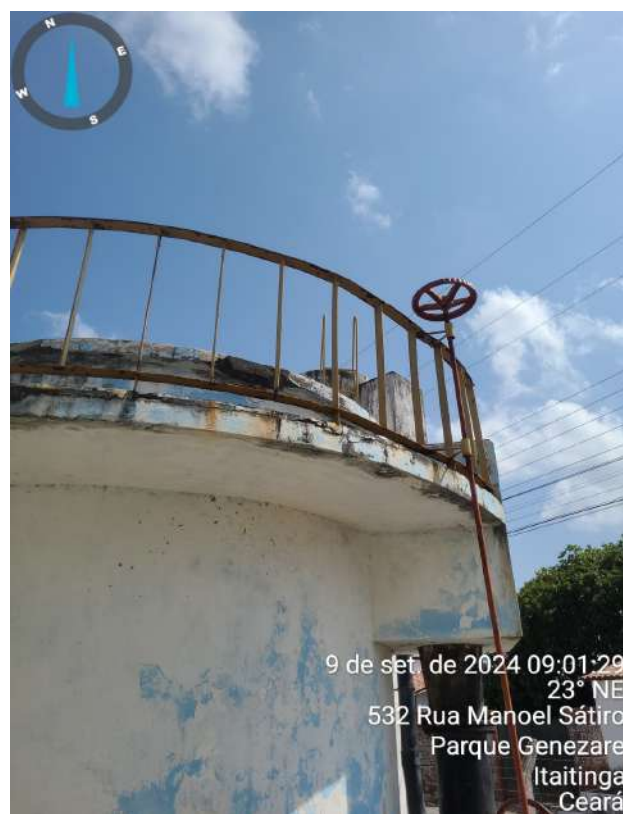
Foto 12 - Filtros F-01 / F-02: pintura deteriorada, e guarda-corpo corroído.
