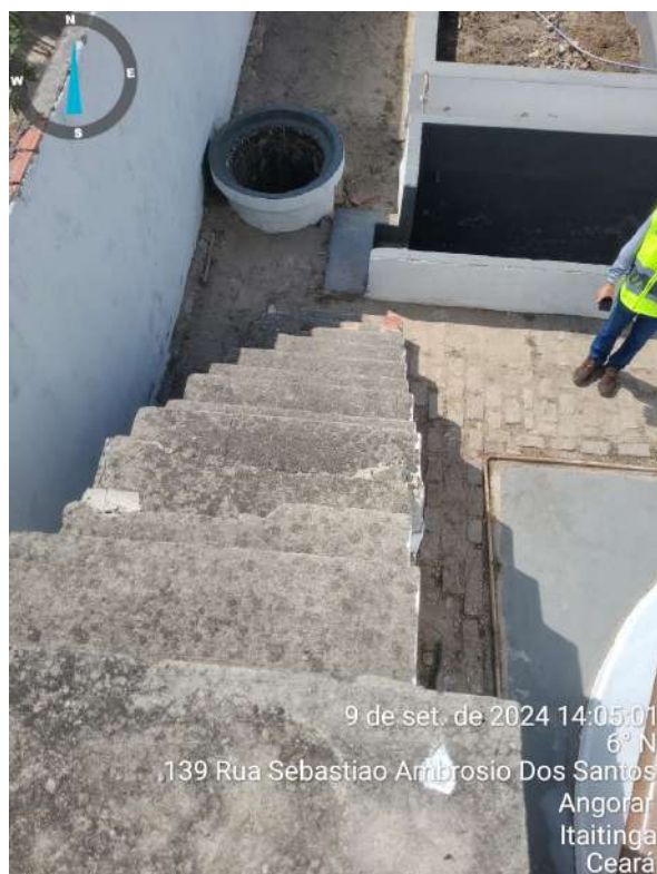
Foto 25 - ETE PROURB II (Angorá): escada com estrutura comprometida e sem guarda-corpo.
