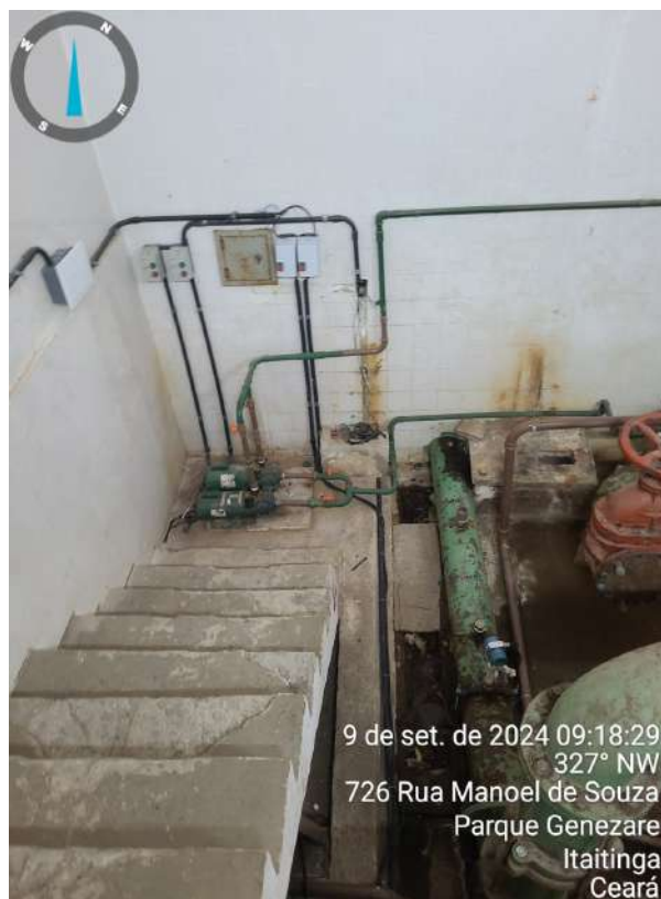
Foto 21 - EEAT-01: ausência de guarda-corpo.
