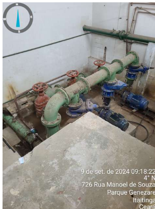
Foto 22 - EEAT-01: ausência de guarda-corpo.
