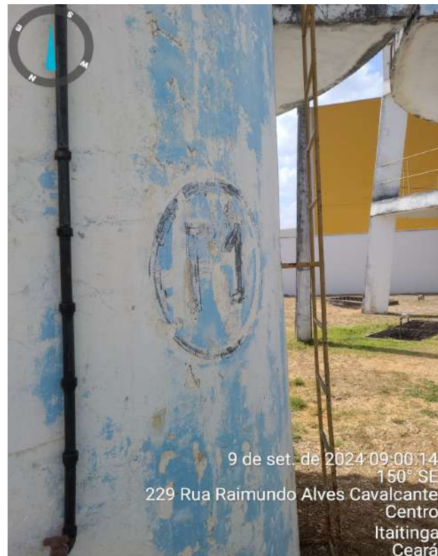
Foto 8 - Filtros F-01 / F-02: pintura deteriorada, identificação precária e escada corroída.
