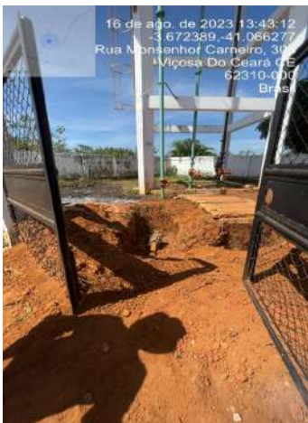
Foto 5 - REL-32: macromedidor não possui caixa de proteção.
