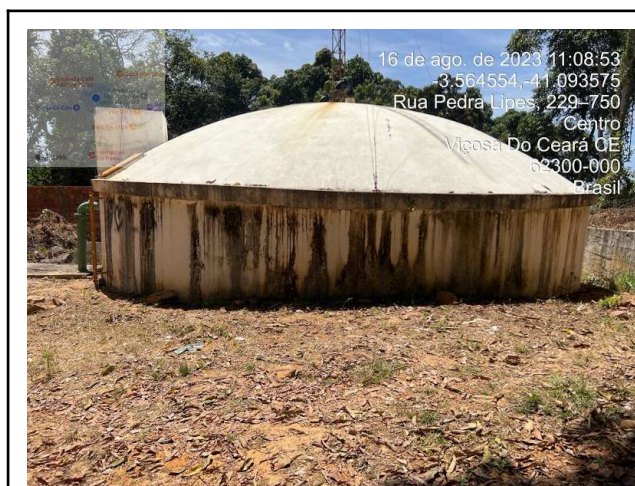
Foto 7 - RAP-06: péssimo estado de conservação, pintura deteriorada.
