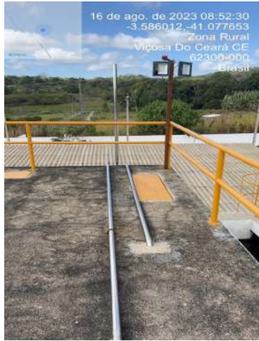
Foto 11 - ETE (Sede): Não Há sistema para queima de gases.
