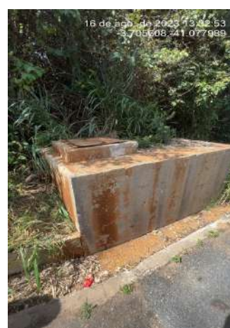
Foto 10 - DQP (adutora Quatiguaba): tampa sem fechamento adequado.
