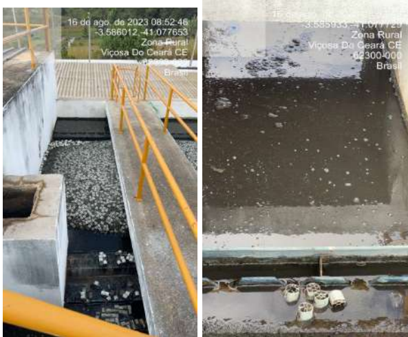
Foto 13 - ETE (Sede): do conjunto que se encontra ativado (UASB, FAS, Decantador e Tanque de Contato) o FAS não funciona como um sistema aeróbio (sistema de aeração não está funcionando) e há escape de meio filtrante para o decantador e tanque de contato.
