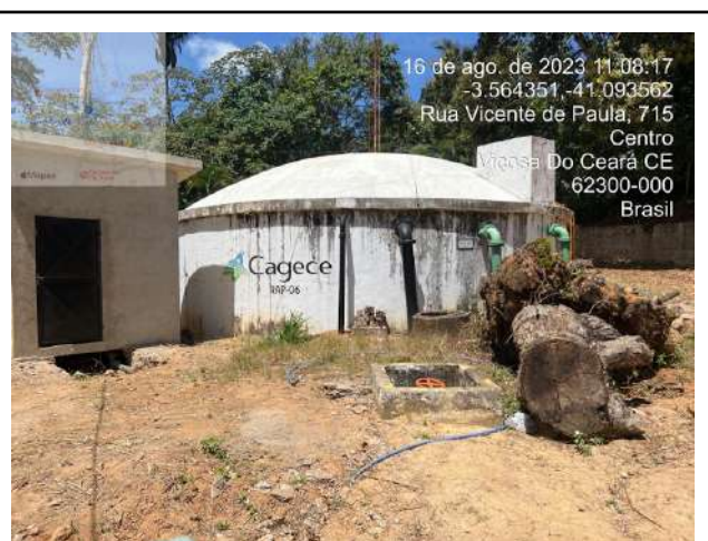
Foto 8 - RAP-06: péssimo estado de conservação, pintura deteriorada.
