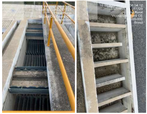
Foto 12 - ETE (Sede): Um conjunto dos equipamentos do lado direito (UASB, FAS, decantador e tanque de contato) estão desativados.
