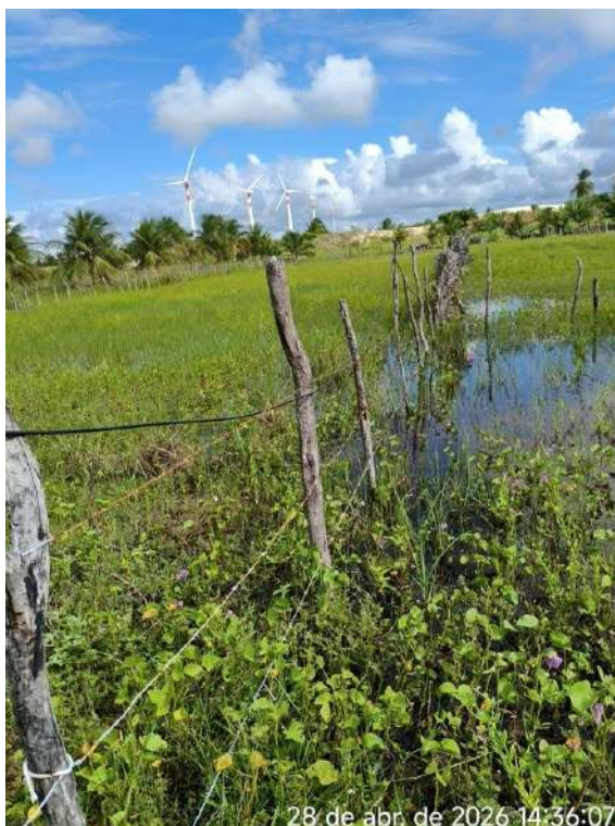
Foto 42 - Captação ( Mundaú ): Cabeamento elétrico dos poços inadequado.
