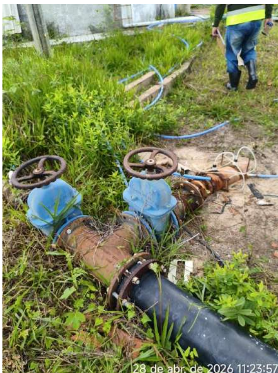
Foto 3 - ETA / Pátio (Trairi): tubulações e conexões expostas e desordenadas, e vegetação, em área de circulação.
