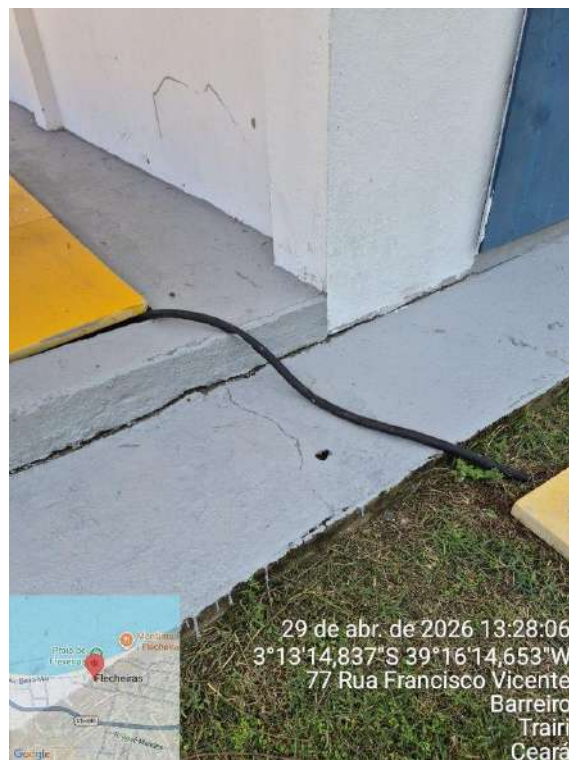
Foto 57 - EEE-01 (Flecheiras): cabo elétrico exposto sem a devida proteção.
