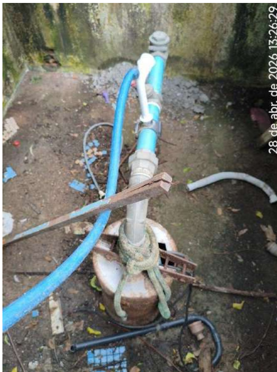
Foto 94 - PT-04 (Flecheiras): caixa com sujidades.
