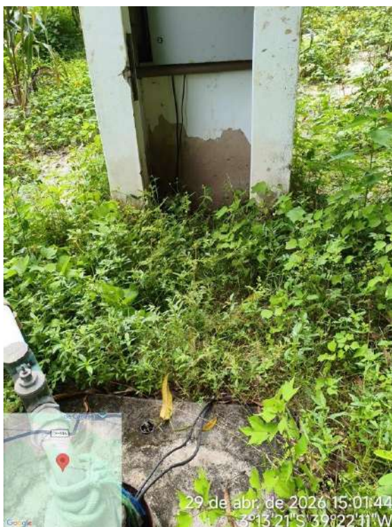
Foto 28 - Poços (Canaã): Cabeamento elétrico sem isolamento de proteção.
