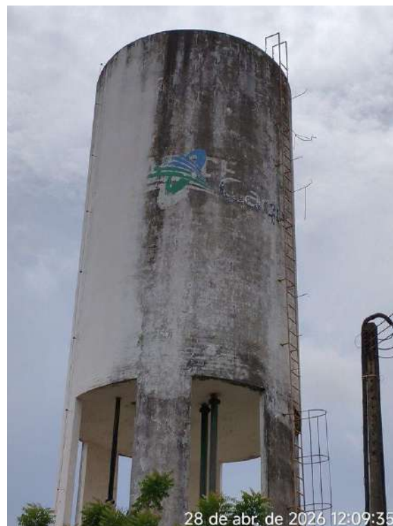
Foto 71 - REL-02 (Trairi): escada danificada em processo de corrosão.
