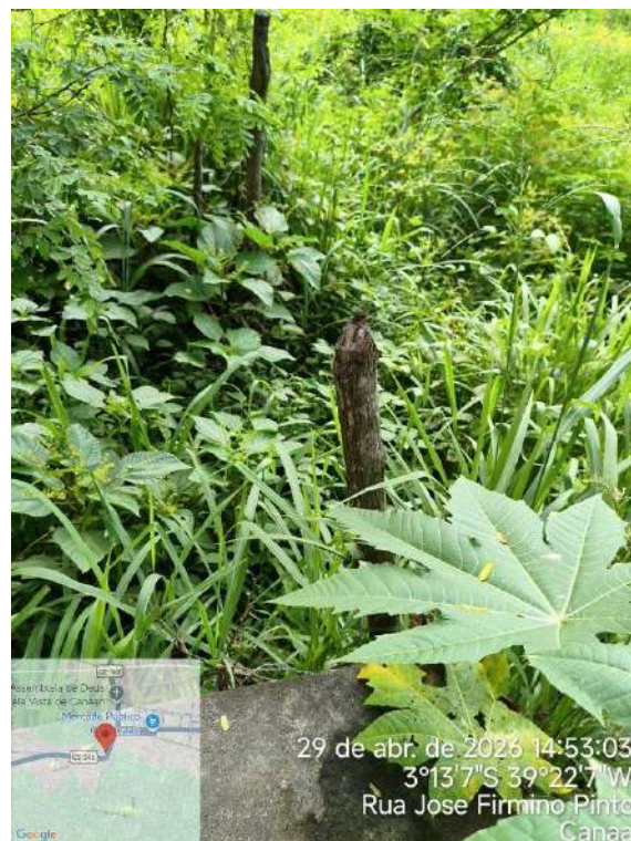
Foto 83 - RSE / EEAT (Canaã): cerca deteriorada; desenvolvimento de vegetação.
