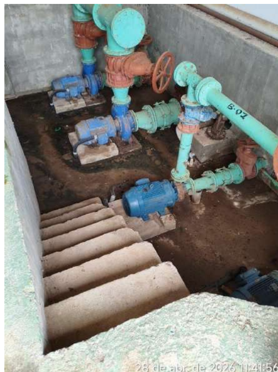
Foto 12 - EEAT-01 / EELF-01 (Trairi): escada de acesso sem corrimão, piso molhado e sujidades.
