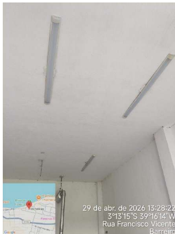
Foto 119 - EEE-01 (Flecheiras): iluminação interna não funcional na casa do gerador.
