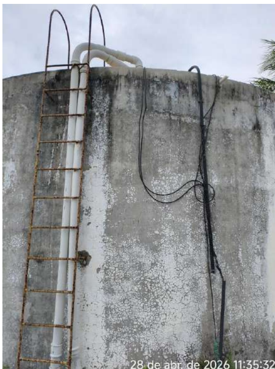
Foto 9 - RAP-01 (Trairi): sem identificação; escada inadequada, corroída; laje de cobertura sem grade de proteção; cabeamento elétrico sem isolamento de proteção.
