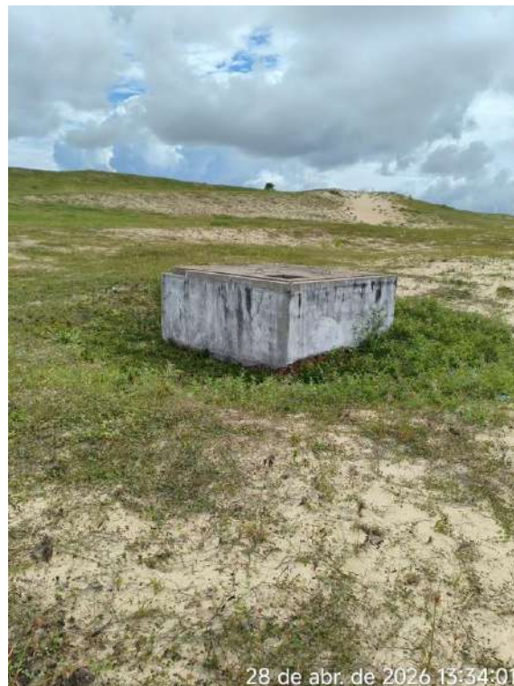
Foto 31 - PT-02 (Flecheiras): Caixa de proteção do poço sem tampa; área sem isolamento perimetral e de segurança.
