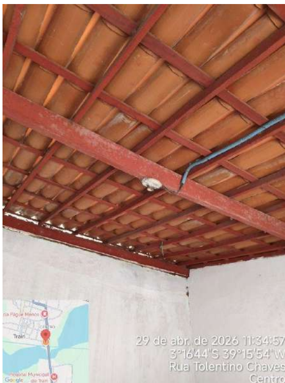
Foto 110 - EEE-01 (Trairi): iluminação interna não funcional.
