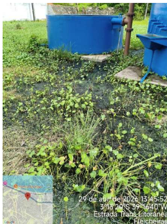
Foto 125 - EEE-01 (Flecheiras): sinais de vazamento e/ou extravasamento de esgotos.
