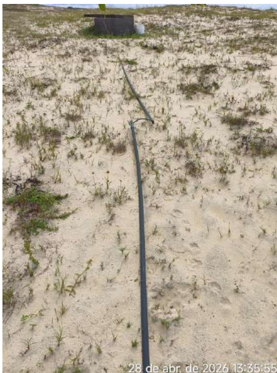
Foto 96 - Adutora (Flecheiras): eletroduto danificado.
