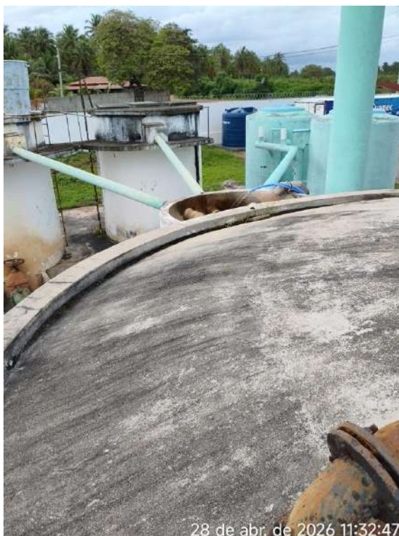
Foto 11- RAP-01 (Trairi): caixa de entrada da água filtrada sem tampa de proteção; laje de cobertura sem grade de proteção.
