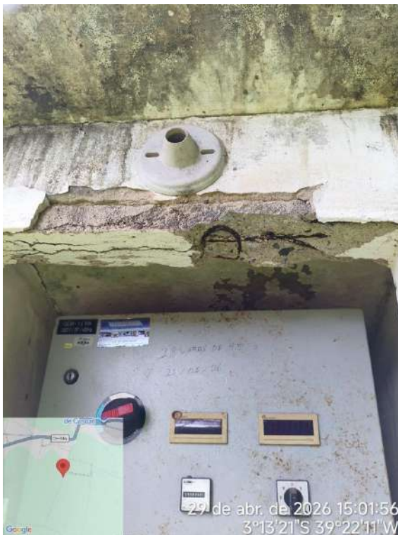
Foto 90 - Poços (Canaã): iluminação não funcional.
