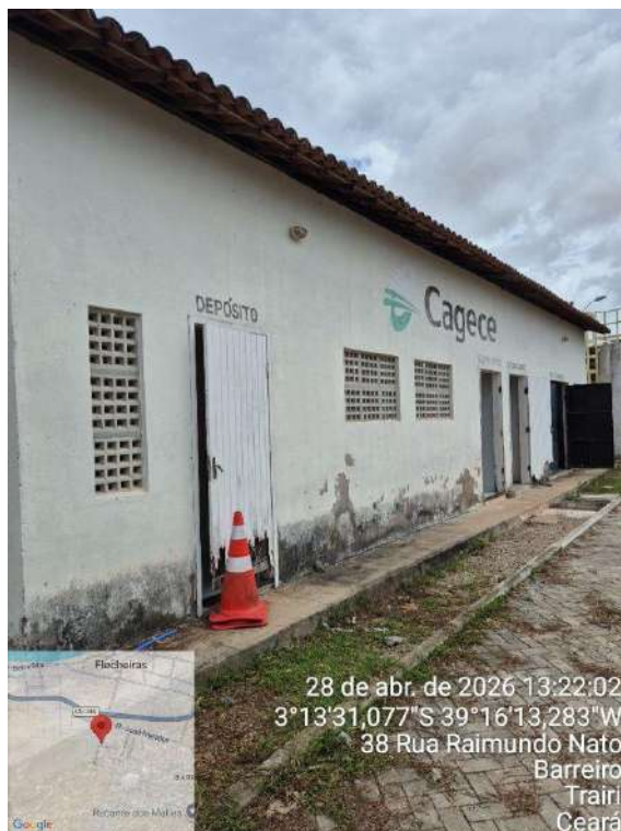
Foto 102 - ETA / EEAT-01 / Sala de Química / Laboratório / Depósito (Flecheiras): pintura e identificação deterioradas.
