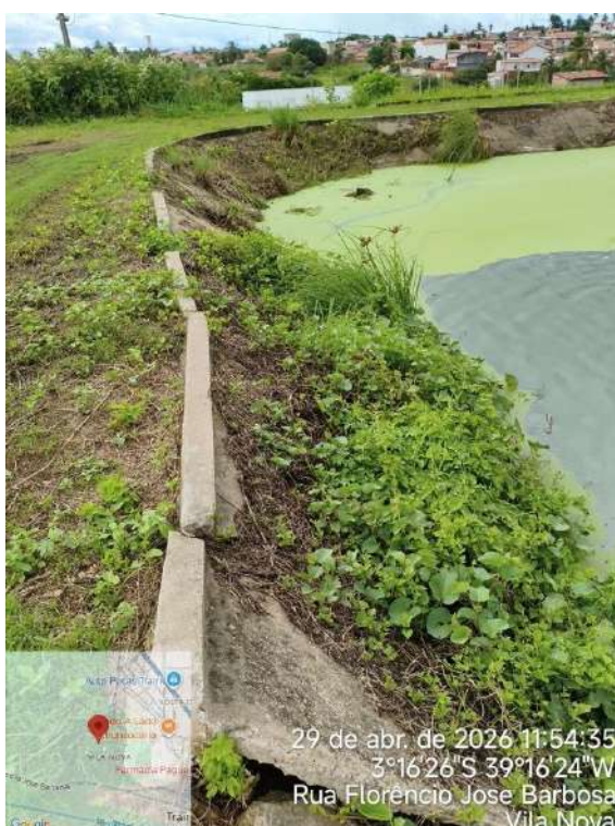
Foto 116 - ETE (Trairi): meio-fios e placas de proteção dos taludes descolados e vegetação crescida.
