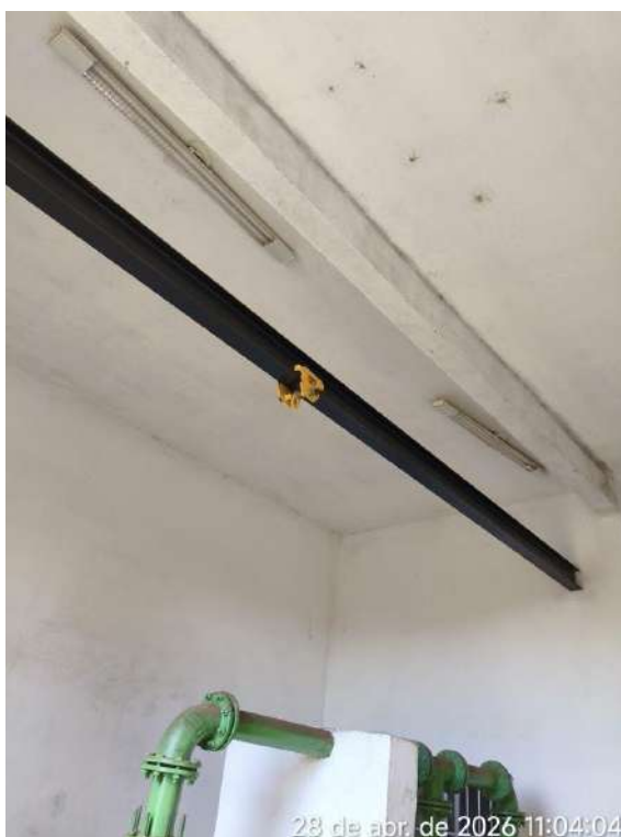
Foto 68 - EEAT-02 (Trairi): EEAT com iluminação não funcional.
