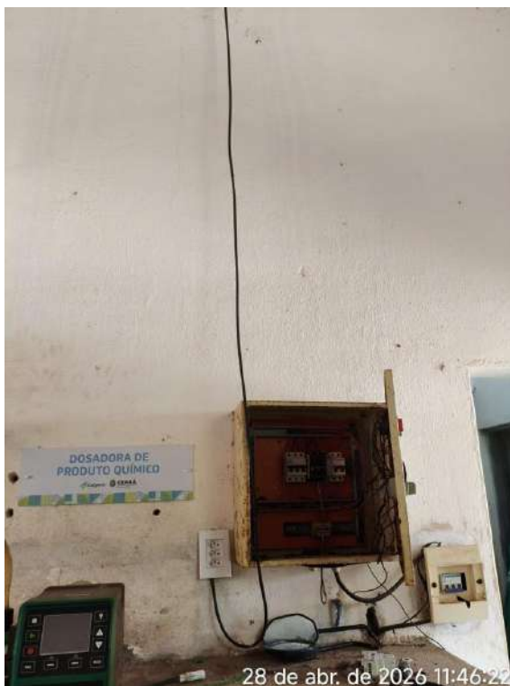
Foto 15 - Laboratório / Casa de Química (Trairi): instalações sem isolamento de proteção.
