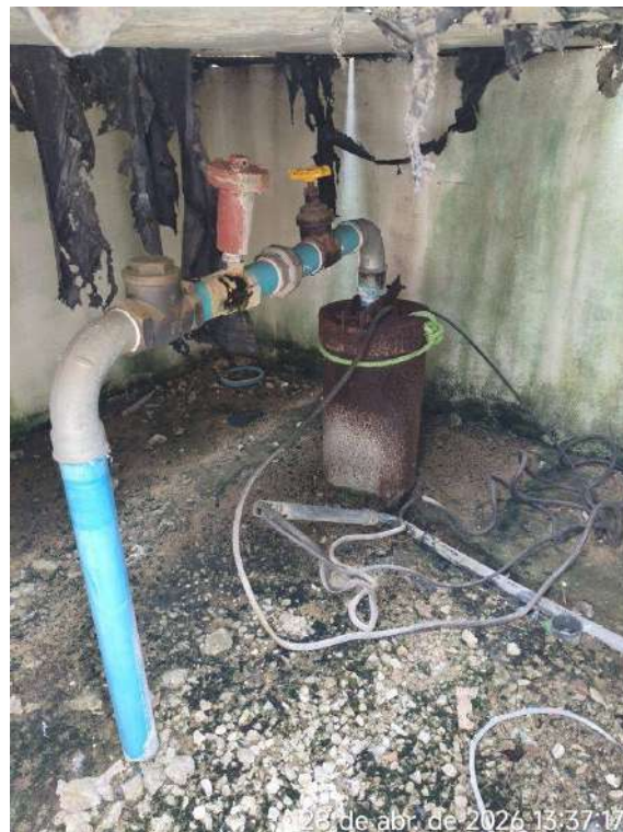
Foto 91 - PT-01 (Flecheiras): Pintura e identificação deterioradas; caixas com sujidades.
