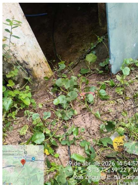
Foto 25 - RSE / EEAT (Canaã): Cabeamento elétrico exposto, através do vão da porta, sobre o piso e sem isolamento de proteção e quadro sobre tijolos.
