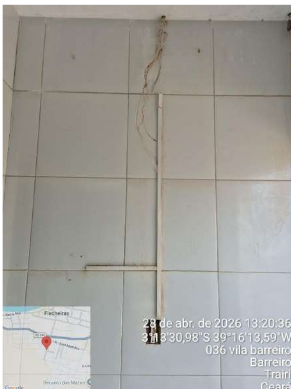
Foto 108 - ETA / Sala de Química (Flecheiras): tomada de energia danificada e fiação exposta.
