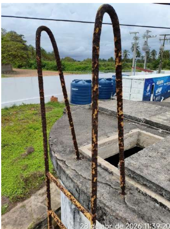
Foto 60 - ETA / Filtros (Trairi): escada corroída; tampa deslocada.
