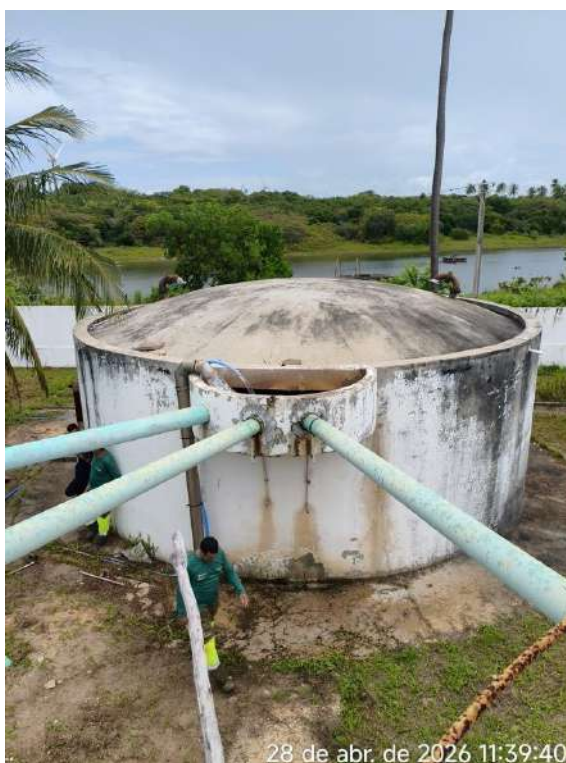
Foto 64 - RAP-01 (Trairi): pintura deteriorada.
