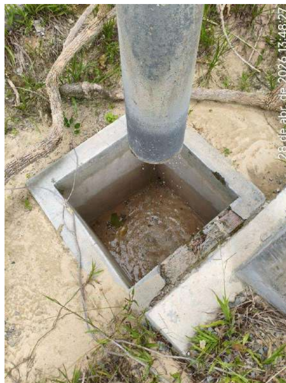
Foto 99 - REL-01 (Flecheiras): pintura e identificação deterioradas.
