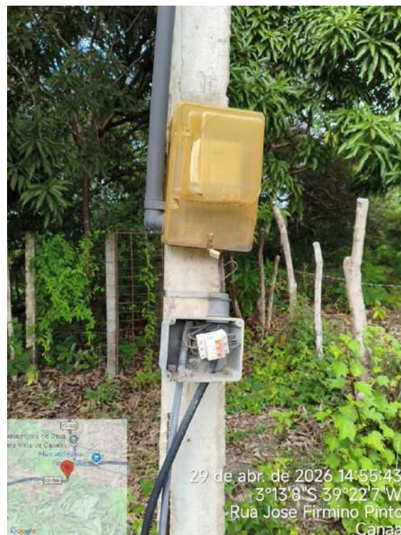
Foto 27 - Poços (Canaã): quadro sem tampa.
