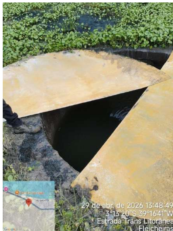
Foto 123 - EEE-01 (Flecheiras): sinais de vazamento e/ou extravasamento de esgotos.
