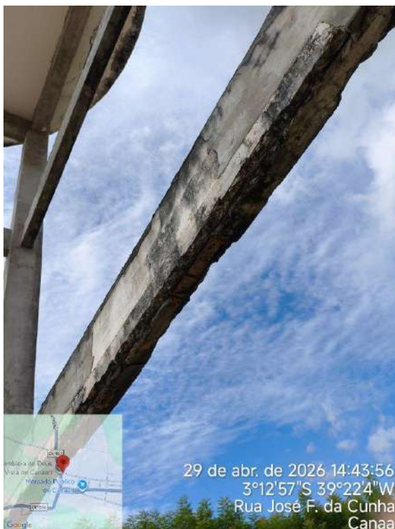
Foto 78 - REL (Canaã): rachaduras e degradação do concreto e ferragens expostas.
