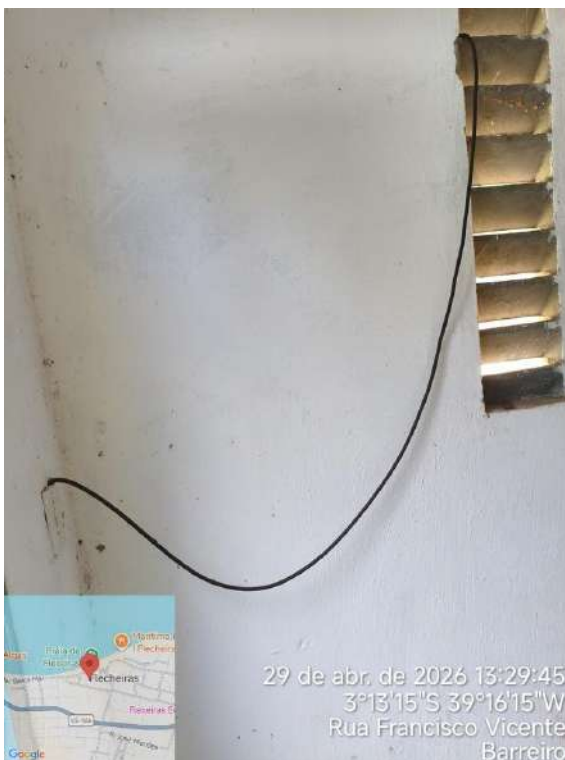
Foto 56 - EEE-01 (Flecheiras): cabo elétrico exposto sem a devida proteção.
