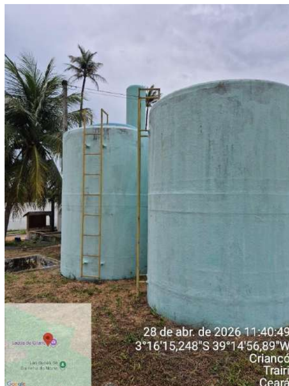
Foto 6 - ETA / Filtros (Trairi): sem identificação; escadas inadequadas.
