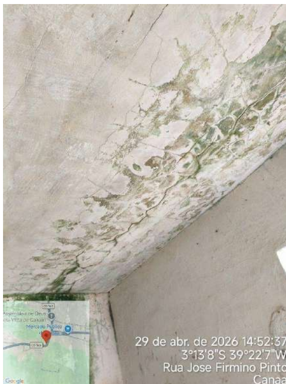
Foto 86 - RSE / EEAT (Canaã): casa de bombas com pintura interna deteriorada e sujeira.
