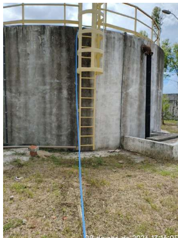
Foto 37 - ETA / REL-01 ( Flecheiras ): sem identificação; tubulação de cloração improvisada, exposta na área de circulação, instalada através da abertura de inspeção.
