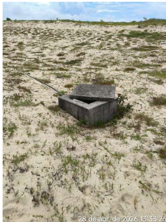
Foto 95 - Adutora (Flecheiras): caixa de passagem com tampa aberta.
