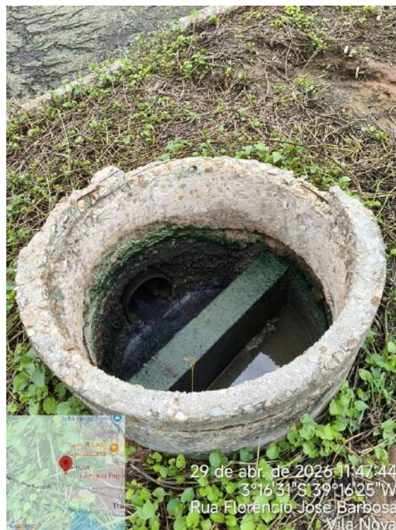
Foto 115 - ETE (Trairi): caixa de esgoto danificada sem tampa, na área de circulação do talude.
