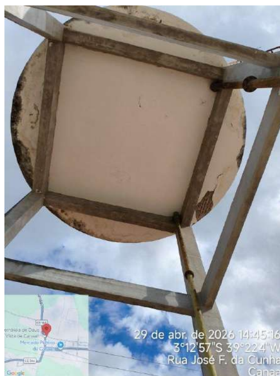
Foto 81 - REL (Canaã): rachaduras e degradação do concreto e ferragens expostas.
