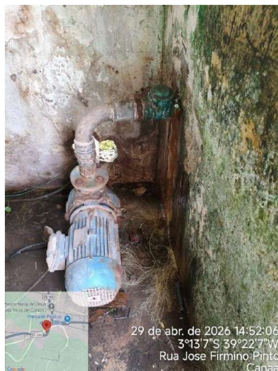
Foto 85 - RSE / EEAT (Canaã): casa de bombas com pintura interna deteriorada e sujeira.
