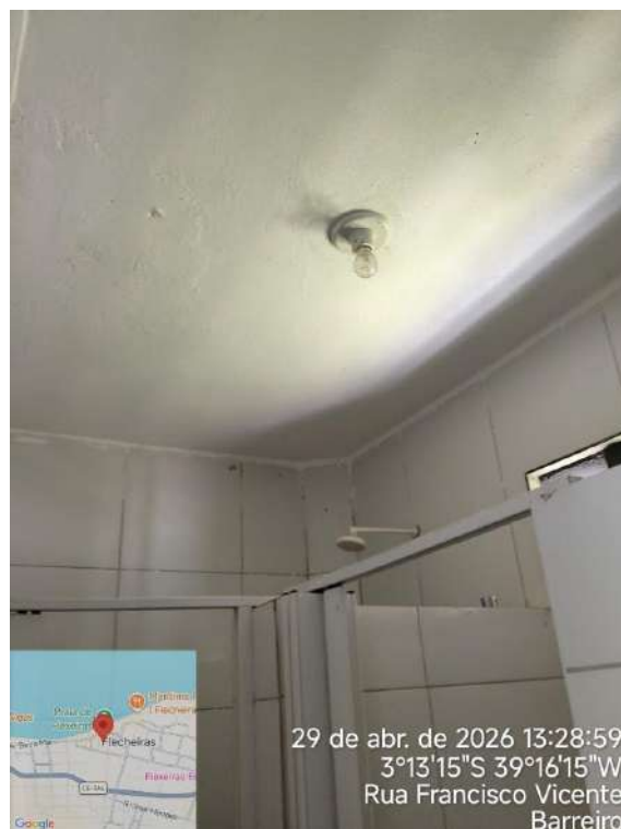
Foto 121 - EEE-01 (Flecheiras): iluminação interna não funcional no banheiro.
