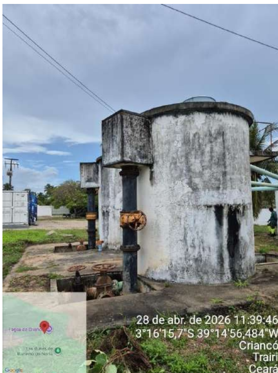
Foto 7 - Filtros (Trairi): sem identificação e pintura deteriorada
