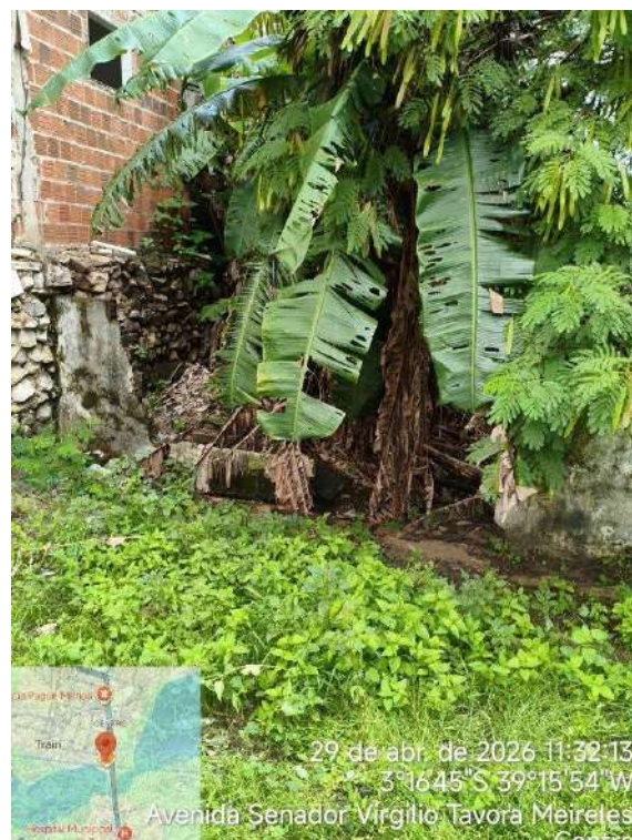
Foto 109 - EEE-01 (Trairi): muro desmoronado e vegetação crescida.
