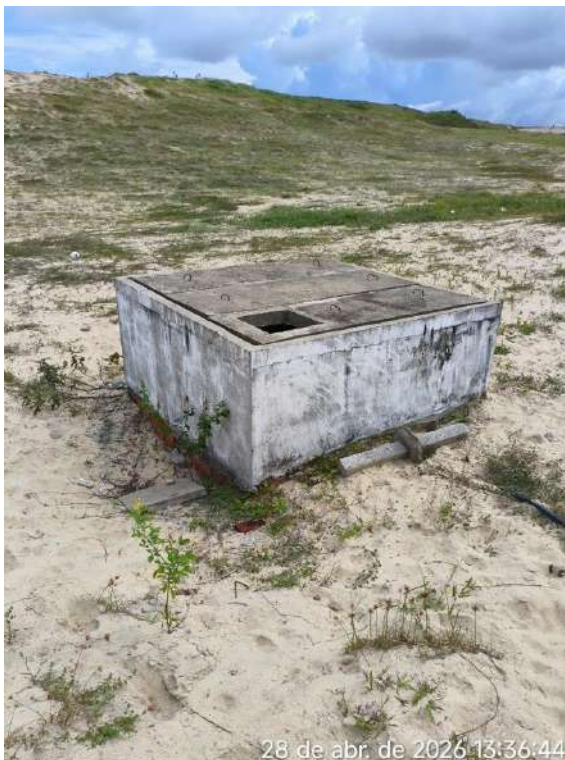
Foto 30 - PT-01 (Flecheiras): Caixa de proteção do poço sem tampa; área sem isolamento perimetral e de segurança.
