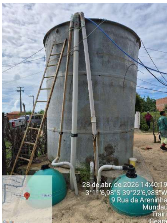
Foto 52 - ETA / RAP-01 (Mundaú): sem identificação e sem cobertura, escada inadequada.
