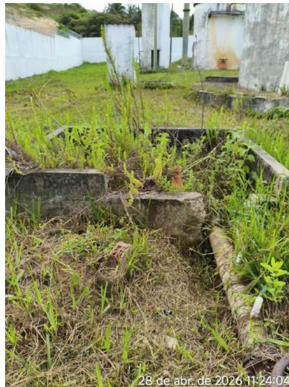
Foto 59 - ETA / Pátio (Trairi): caixa danificada e presença de vegetação.
