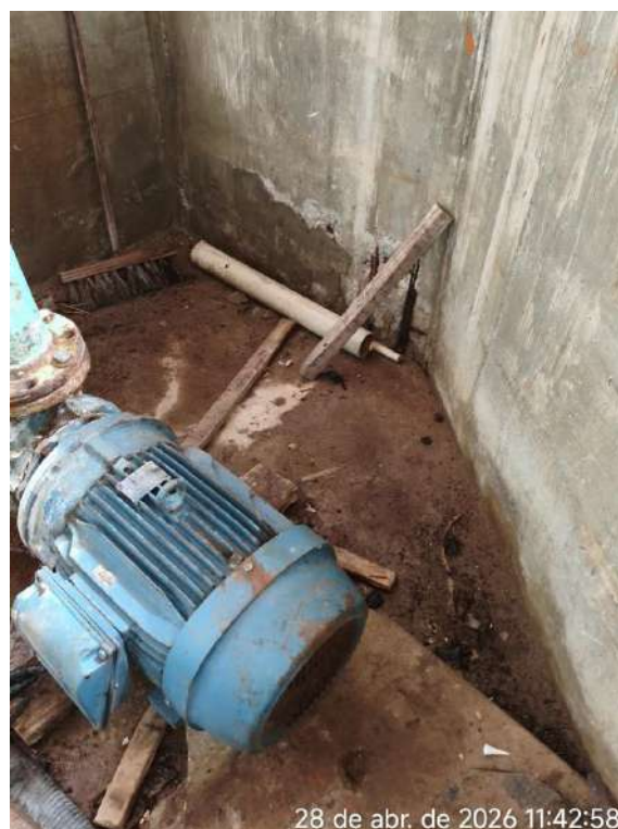
Foto 65 - EEAT-01 / EELF-01 (Trairi): piso com sujidades.
