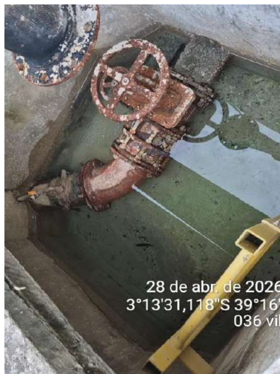
Foto 101 - ETA / RAP-01 (Flecheiras): vazamento na tubulação de saída.
