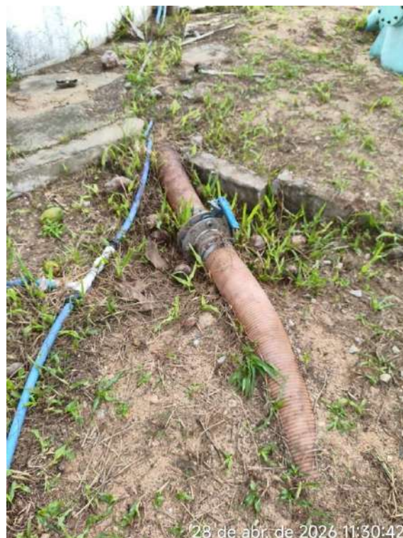
Foto 4 - ETA / Pátio (Trairi): tubulações e conexões expostas e desordenadas, em área de circulação.
