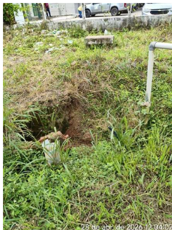
Foto 73 - REL-02 (Trairi): caixa danificada e aberta.
