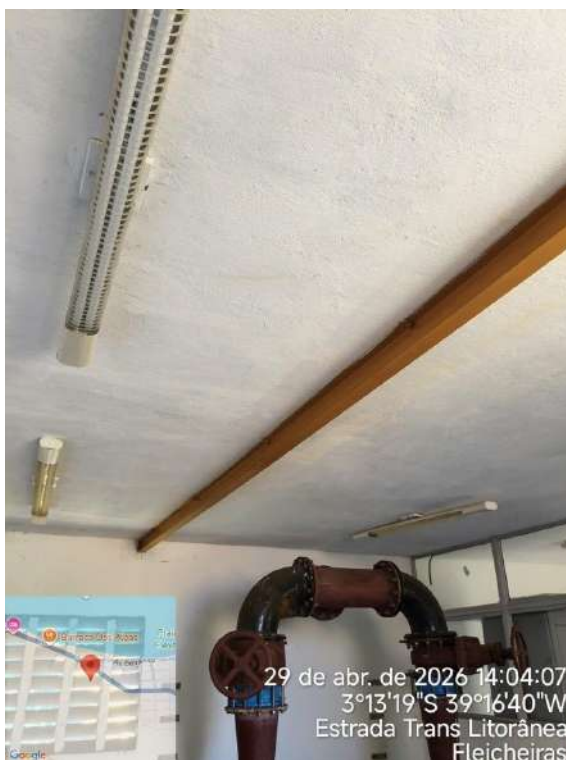
Foto 128 - ETE (Flecheiras): iluminação não funcional na casa de máquinas.
