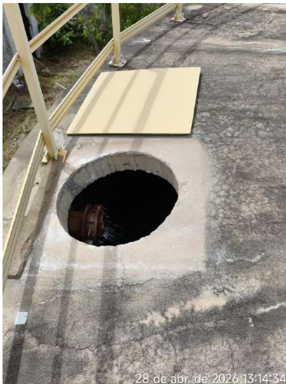
Foto 38 - ETA / RAP-01 ( Flecheiras ): abertura de proteção sem fecho hermético, vulnerável à contaminação.
