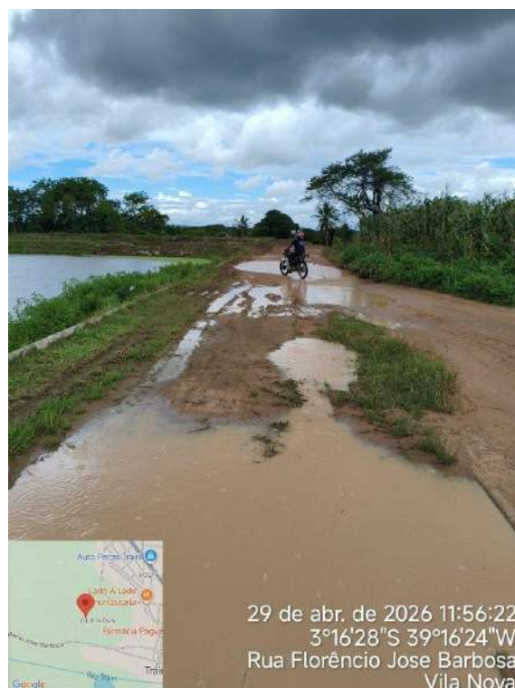
Foto 113 - ETE Trairi: tráfego de veículo por sobre o talude da lagoa.
