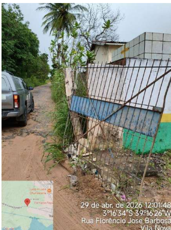
Foto 112 - ETE (Trairi): portão de entrada danificado.
