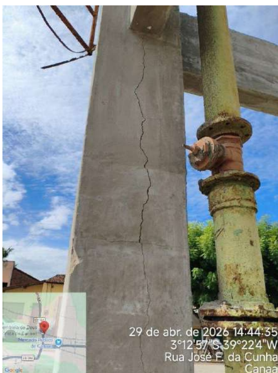
Foto 80 - REL (Canaã): rachaduras e degradação do concreto.
