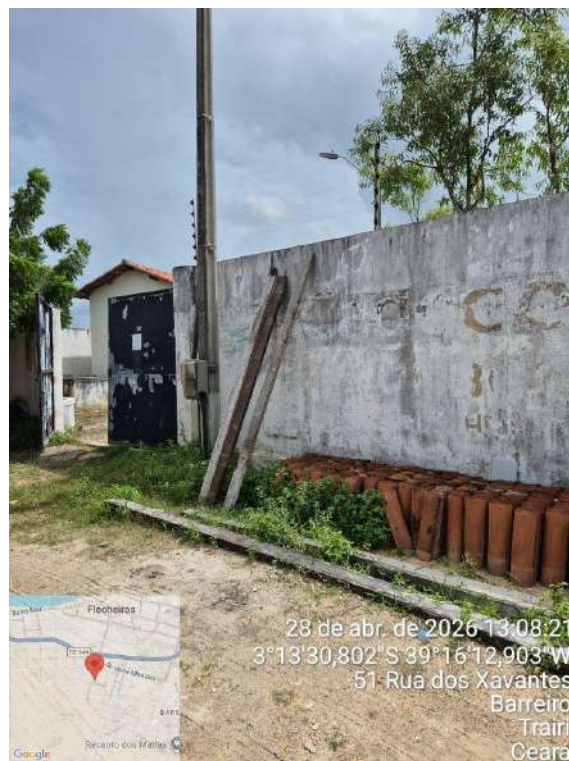
Foto 97 - ETA (Flecheiras): pintura e identificação do muro frontal desgastadas.
