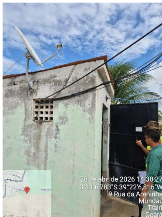
Foto 49 - ETA / EEAT-01 (Mundaú): Sem identificação; cabeamento instalado através de cobogós e sem isolamento de proteção.
