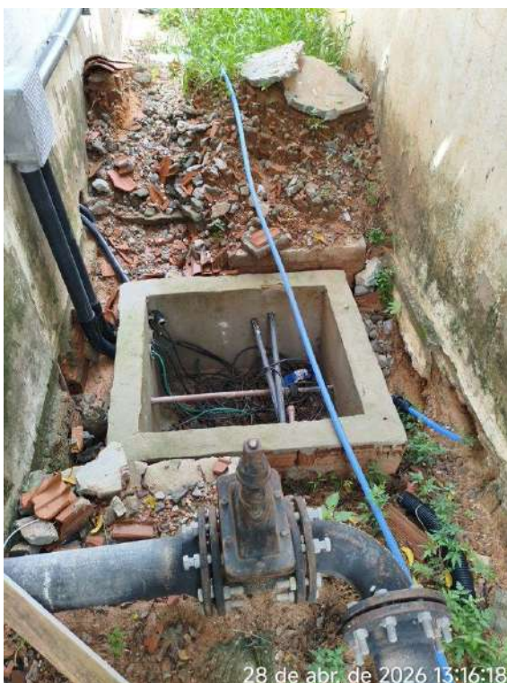
Foto 36 - ETA / Pátio ( Flecheiras ): caixa de passagem sem tampa; tubulação de cloração improvisada, exposta na área de circulação.
