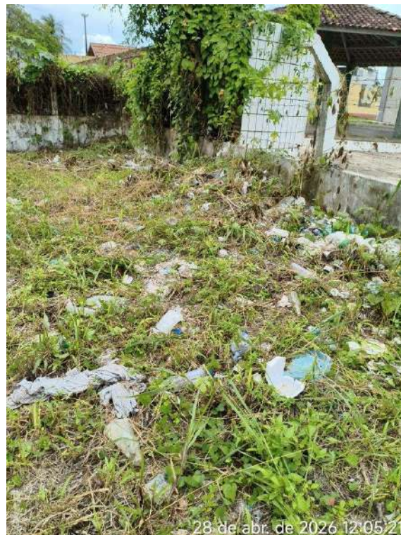
Foto 75 - REL-02 (Trairi): pátio do reservatório com descarte irregular de resíduos sólidos.
