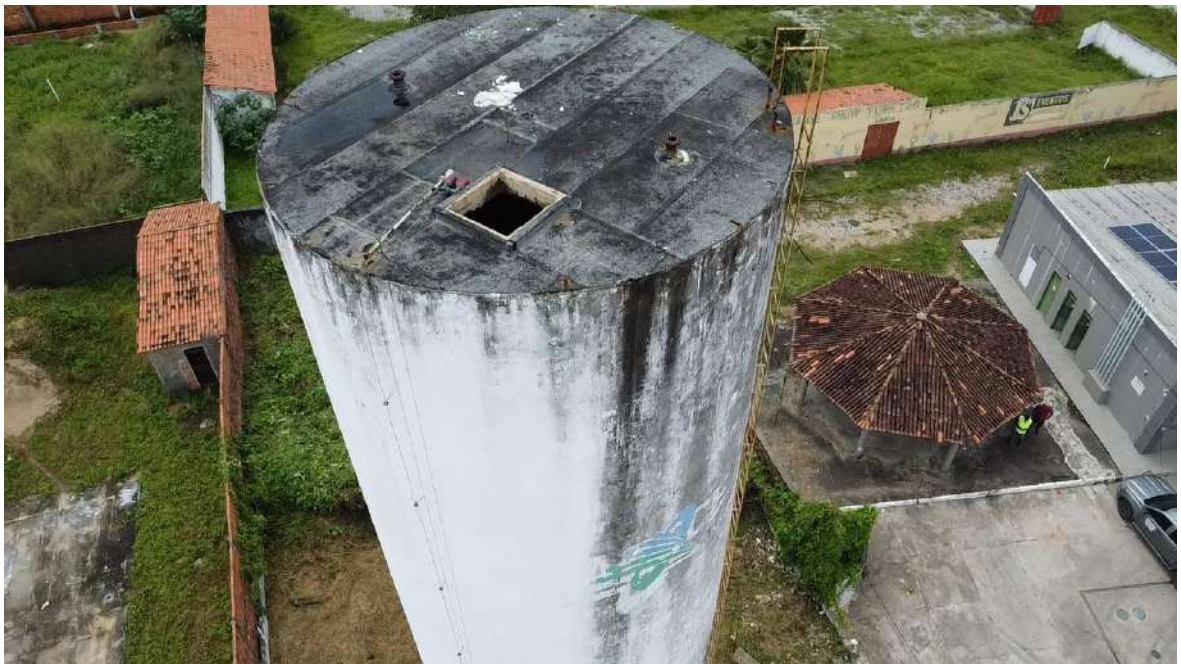
Foto 22 - REL-02 (Trairi): pintura e identificação deterioradas; laje sem guarda-corpo; ausência de tampa na abertura de inspeção; tubos de ventilação inadequados, sem curva e sem tela de proteção.
