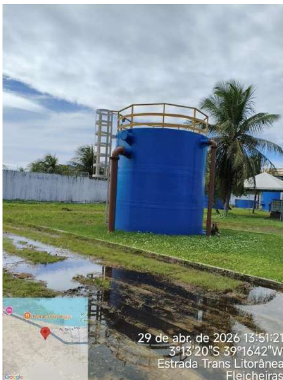
Foto 126 - EEE-01 (Flecheiras): sinais de vazamento e/ou extravasamento de esgotos.
