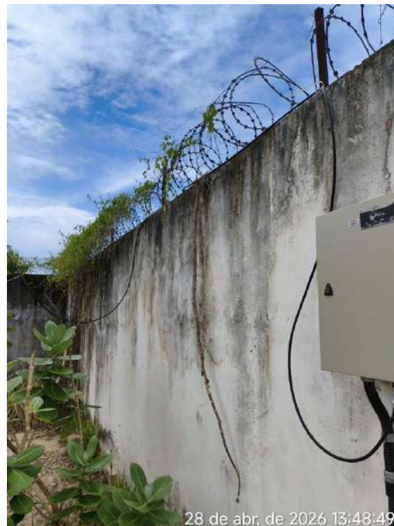
Foto 35 - ETA / Pátio ( Flecheiras ): cabeamento sem isolamento de proteção.
