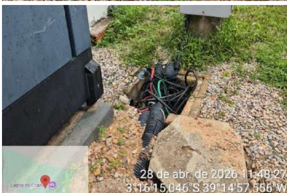
Foto 58 - ETA / Pátio (Trairi): caixa danificada e presença de vegetação.
