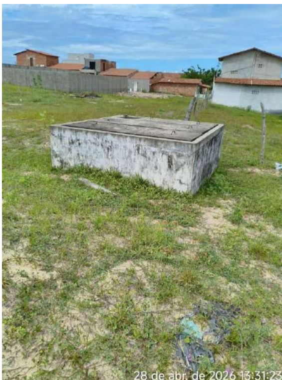
Foto 32 - PT-03 (Flecheiras): Caixa de proteção do poço sem tampa; área sem isolamento perimetral e de segurança.
