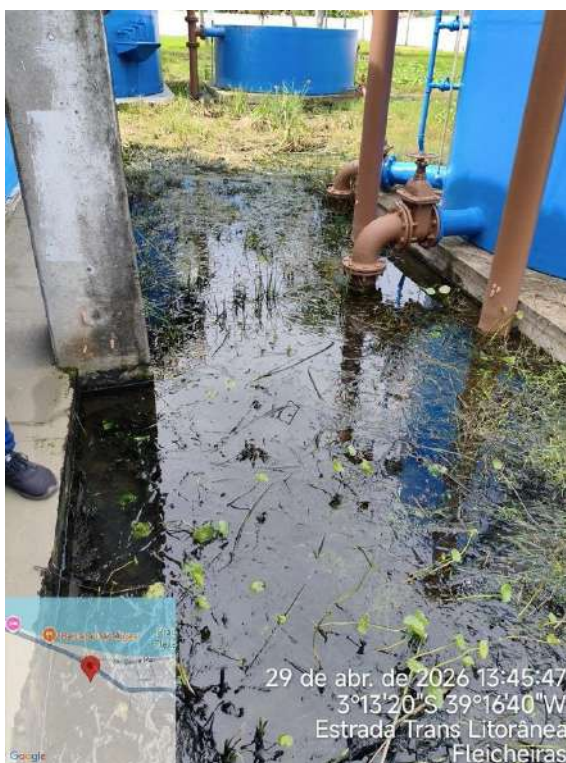
Foto 124 - EEE-01 (Flecheiras): sinais de vazamento e/ou extravasamento de esgotos.
