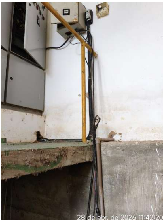
Foto 13 - EEAT-01 / EELF-01 (Trairi): instalações sem isolamento de proteção.
