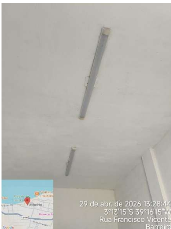
Foto 120 - EEE-01 (Flecheiras): iluminação interna não funcional na casa de comando.
