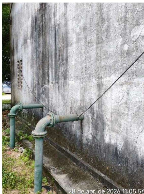
Foto 20 - EEAT-02 (Trairi): elevatória com instalações elétricas, através de cobogós e sem isolamento de proteção.
