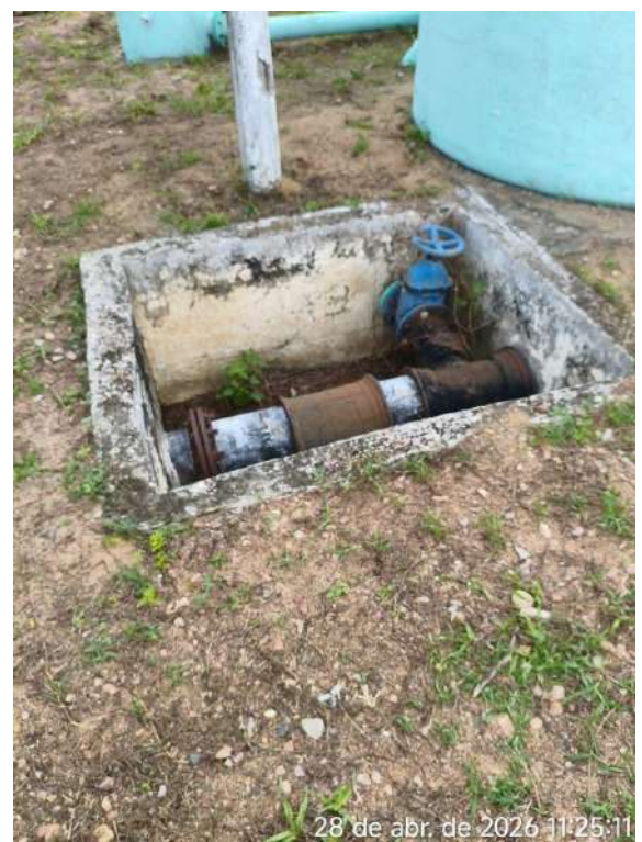
Foto 2 - ETA / Pátio (Trairi): caixas sem tampas, em área de circulação.
