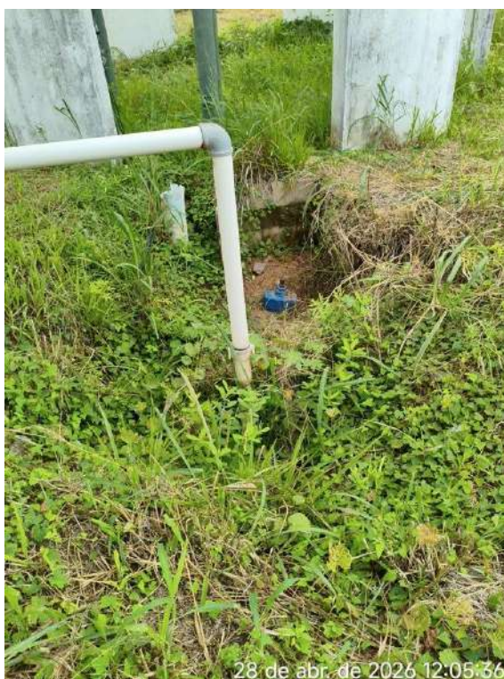
Foto 72 - REL-02 (Trairi): caixa de proteção danificada e aberta.
