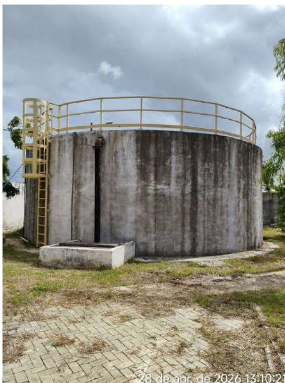
Foto 100 - ETA / RAP-01 (Flecheiras): pintura e identificação desgastada.
