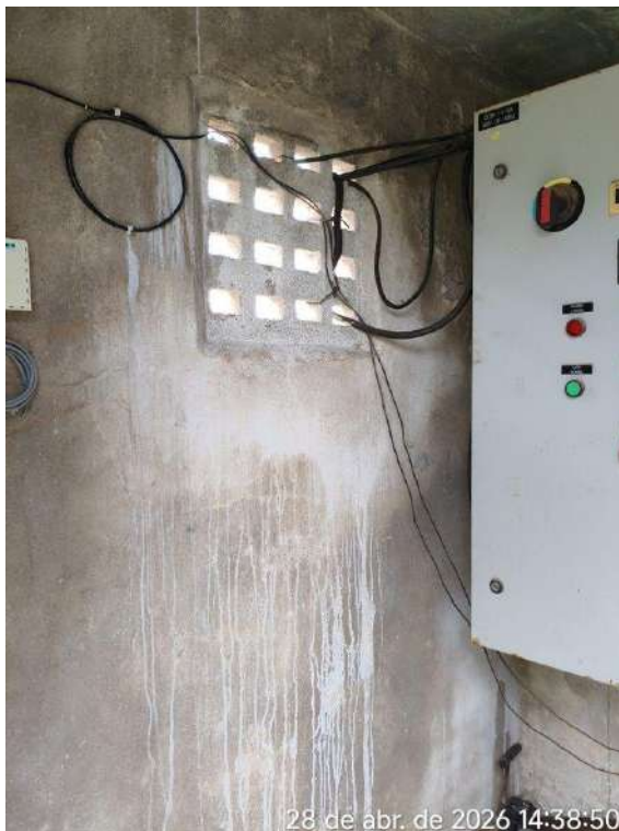
Foto 50 - ETA / EEAT-01 (Mundaú): cabeamento inadequado, instalado através de cobogós e sem isolamento de proteção.
