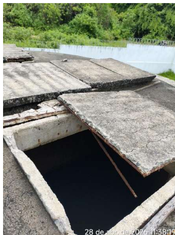
Foto 61 - ETA / Filtros (Trairi): tampa danificada e deslocada.
