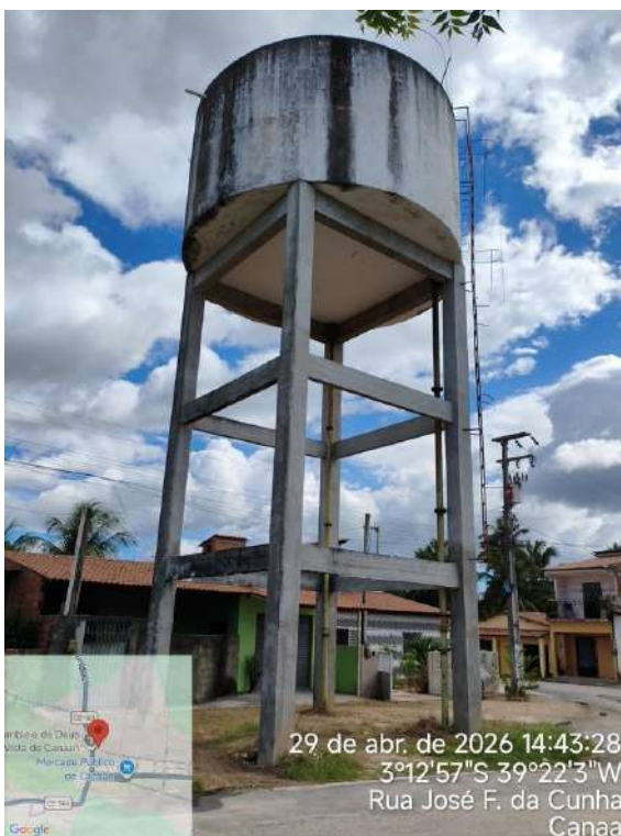
Foto 76 - REL (Canaã): pintura deteriorada; escada danificada / corroídas.
