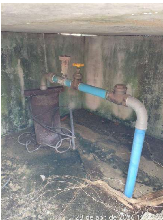
Foto 92 - PT-02 (Flecheiras): caixa com sujidades.
