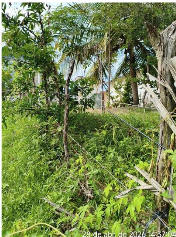
Foto 40 - Captação ( Mundaú ): Cabeamento elétrico dos poços inadequado.
