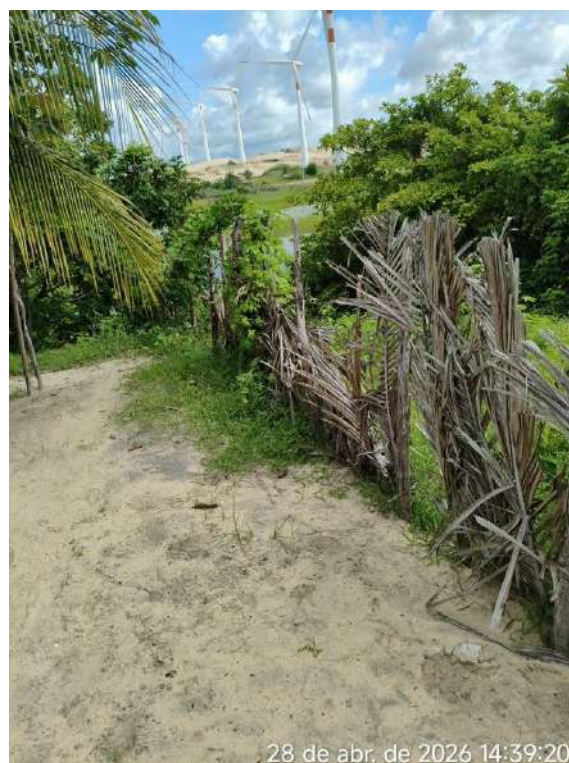
Foto 45 - ETA / Pátio ( Mundaú ): isolamento perimetral precário.
