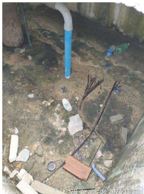
Foto 93 - PT-03 (Flecheiras): caixa com sujidades.
