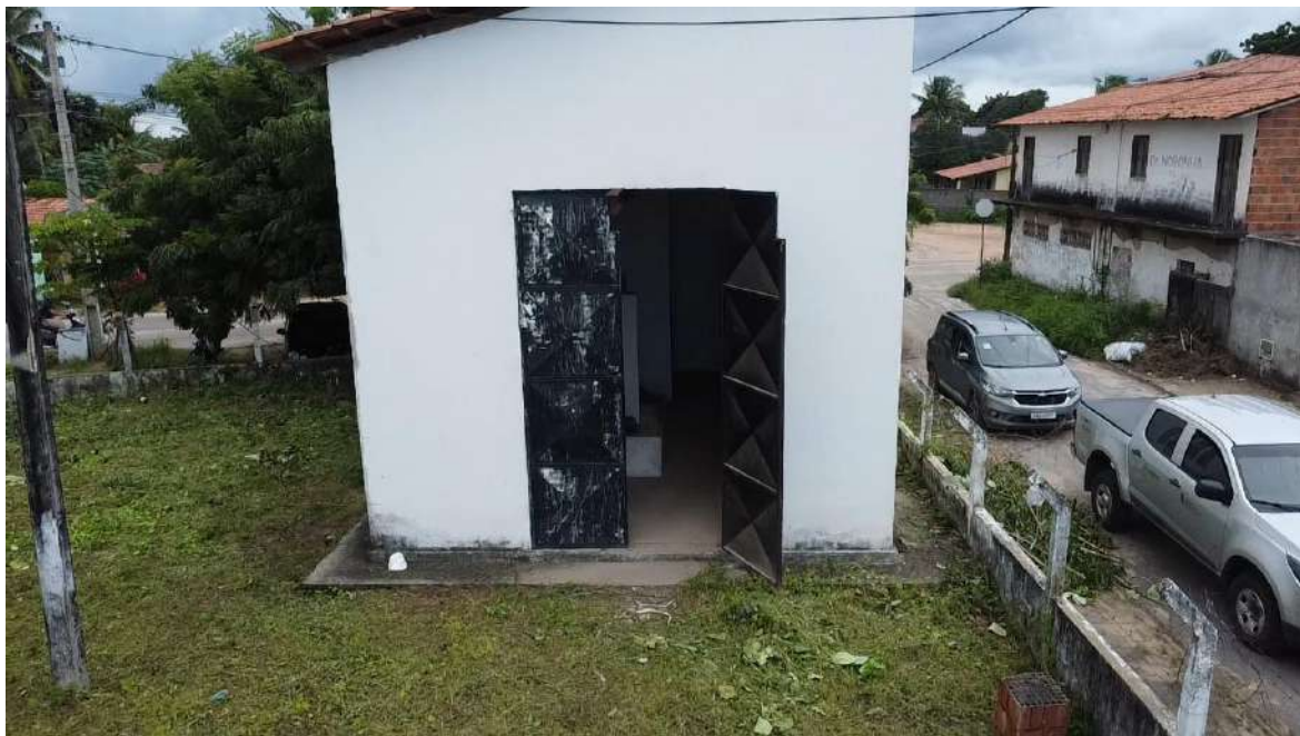
Foto 18 - EEAT-02 (Trairi): elevatória sem identificação.
