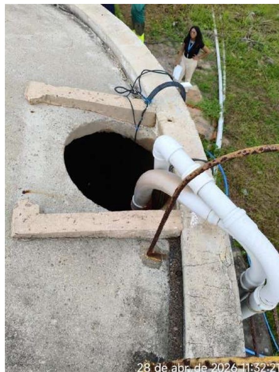
Foto 10 - RAP-01 (Trairi): cabos e tubos instalados através da abertura de inspeção, sem isolamento de proteção; laje de cobertura sem grade de proteção.
