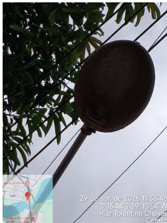
Foto 111 - EEE-01 (Trairi): iluminação externa não funcional.
