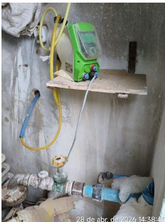
Foto 48 - ETA / Cloração (Mundaú): equipamento sobre base precária.
