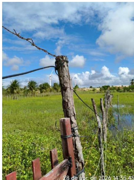
Foto 41 - Captação ( Mundaú ): Cabeamento elétrico dos poços inadequado.
