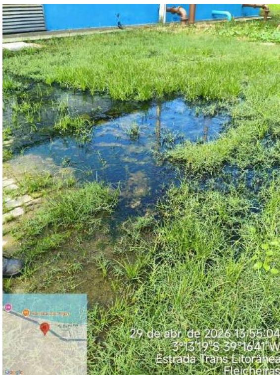
Foto 122 - EEE-01 (Flecheiras): sinais de vazamento e/ou extravasamento de esgotos.
