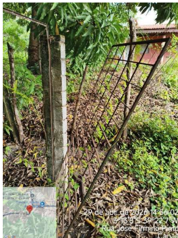
Foto 89 - Poços (Canaã): portão e cerca de isolamento danificados.
