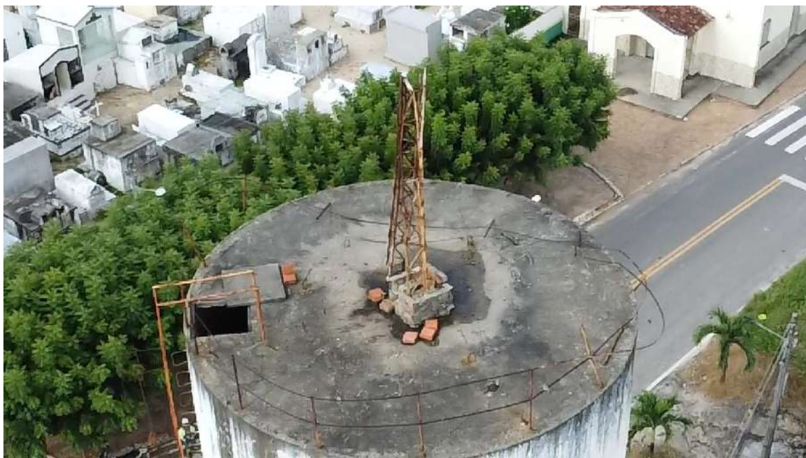
Foto 23 - REL (Canaã): Ausência de identificação e de sistema de pára-raio.
