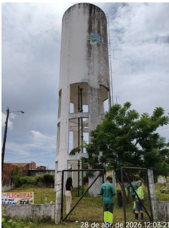
Foto 70 - REL-02 (Trairi): REL com pintura e identificação deterioradas.
