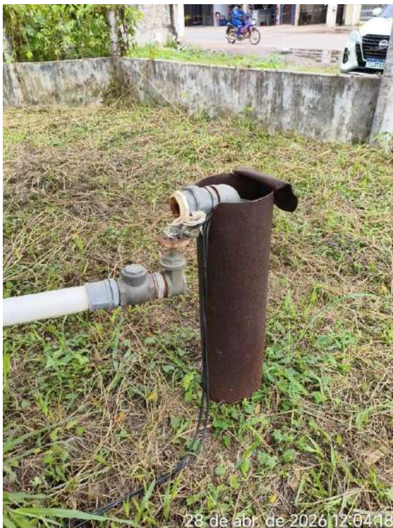
Foto 74 - REL-02 (Trairi): poço desativado sem tamponamento adequado.
