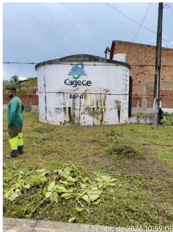
Foto 67 - RAP-02 (Trairi): RAP com pintura deteriorada.
