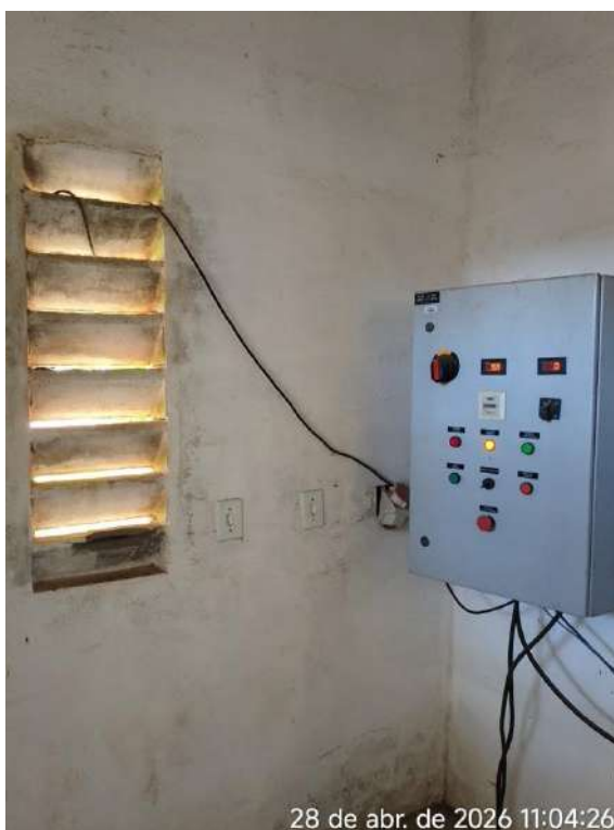
Foto 19 - EEAT-02 (Trairi): elevatória com instalações elétricas, através de cobogós e sem isolamento de proteção.
