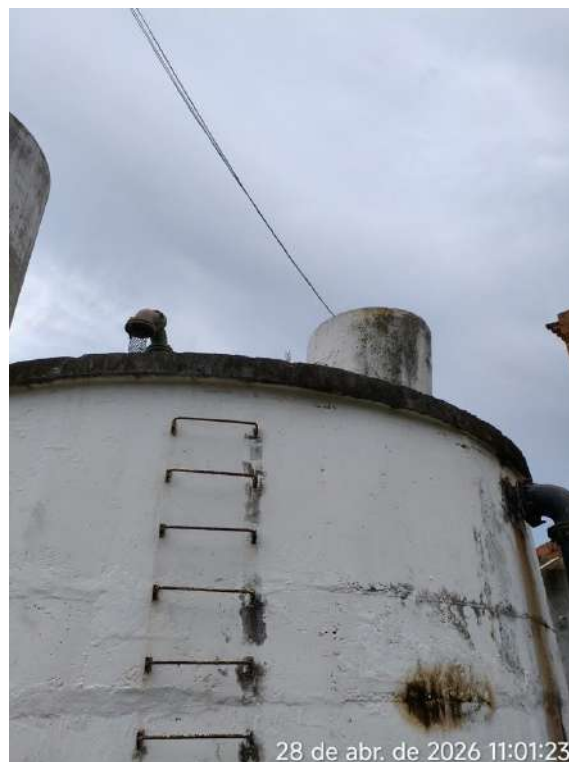
Foto 16 - RAP-02 (Trairi): com escada corroída, sem gaiola e grade de proteção no patamar superior.
