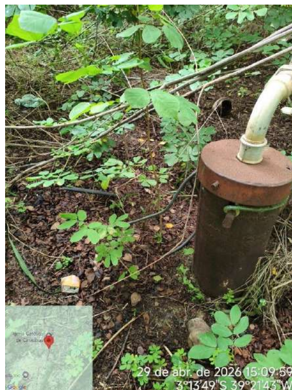
Foto 29 - Poços (Canaã): Cabeamento elétrico sem isolamento de proteção.
