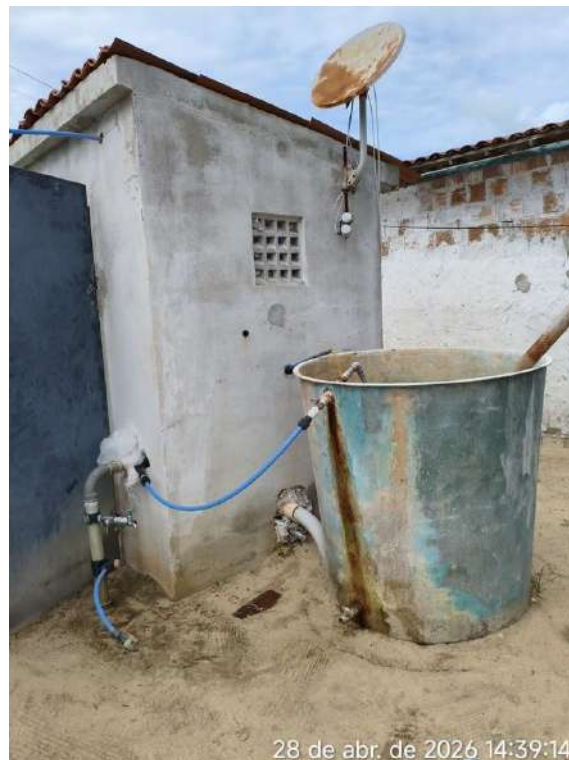
Foto 47 - ETA / Cloração (Mundaú): tanque sem tampa.
