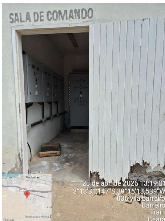
Foto 104 - ETA / Sala de Comando (Flecheiras): depósito com portas danificadas.
