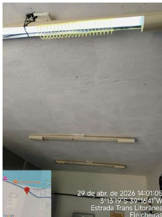
Foto 129 - ETE (Flecheiras): iluminação não funcional na casa de máquinas.
