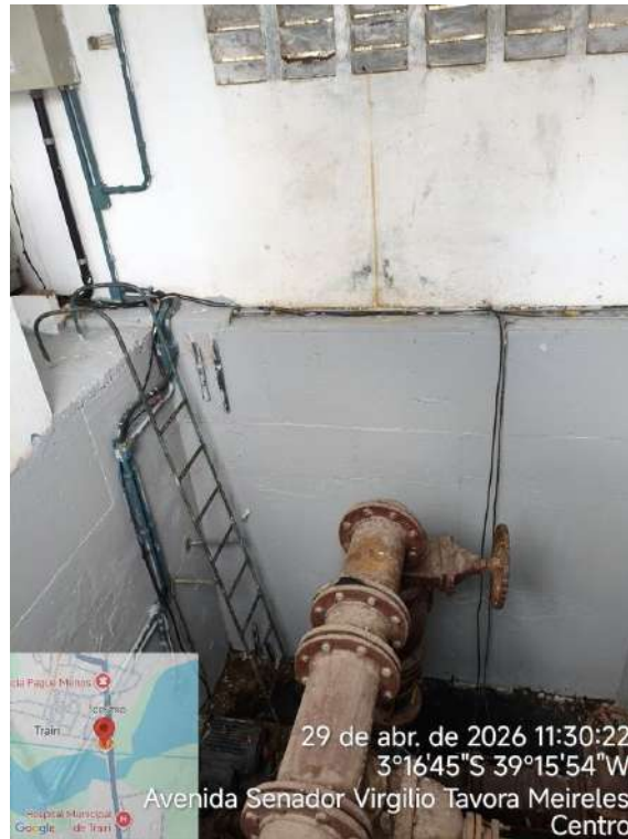
Foto 53 - EEE-01 (Trairi): fiação elétrica sem isolamento de proteção.
