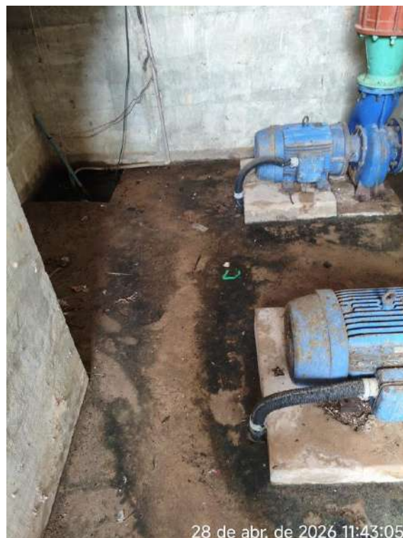
Foto 14 - EEAT-01 / EELF-01 (Trairi): instalações sem isolamento de proteção, piso molhado e sujidades.
