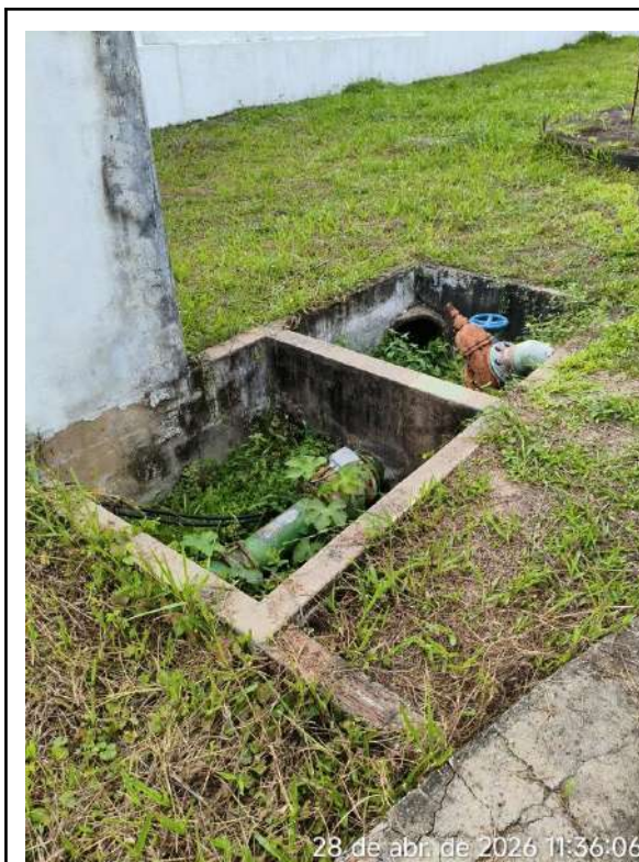
Foto 1 - ETA / Pátio (Trairi): caixas sem tampas, em área de circulação.
