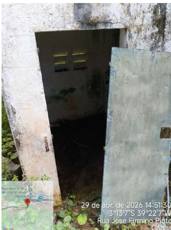
Foto 84 - RSE / EEAT (Canaã): pintura externa deteriorada e porta danificada.
