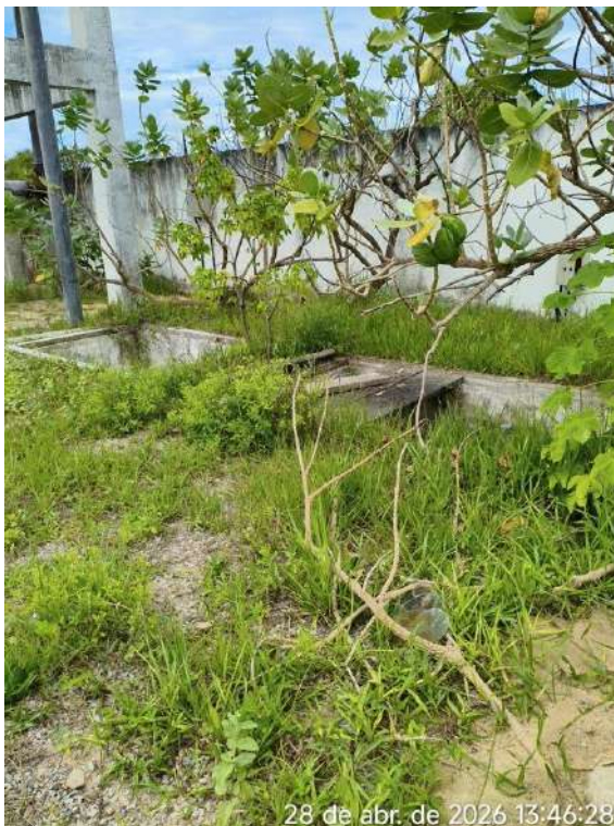
Foto 34 - ETA / Pátio ( Flecheiras ): Caixa de proteção sem tampa; vegetação crescida..
