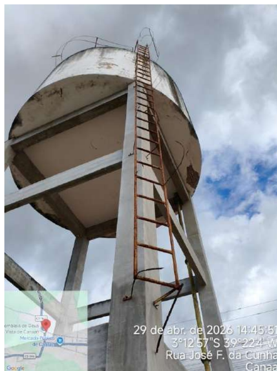
Foto 77 - REL (Canaã): escada e grade de proteção danificadas / corroídas; degradação da estrutura.
