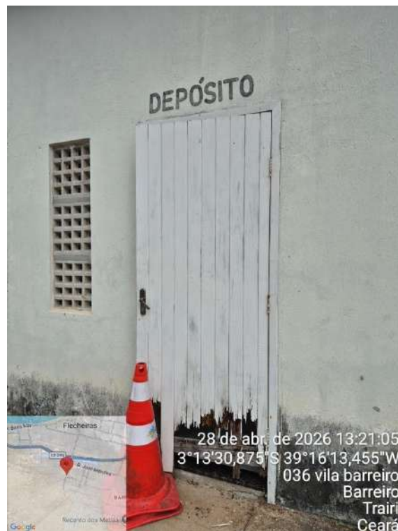
Foto 103 - ETA / Depósito (Flecheiras): depósito com portas danificadas.
