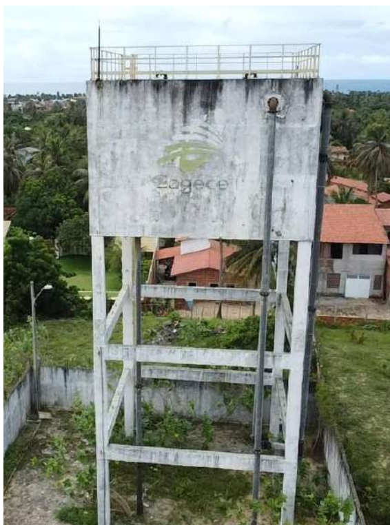
Foto 98 - REL-01 (Flecheiras): pintura desgastada, identificação ilegível.
