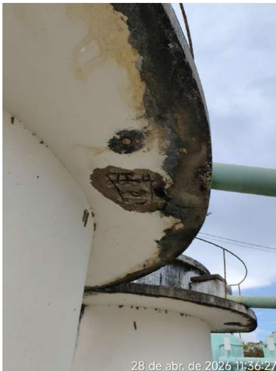
Foto 62 - ETA / Filtros (Trairi): anomalia na estrutura.
