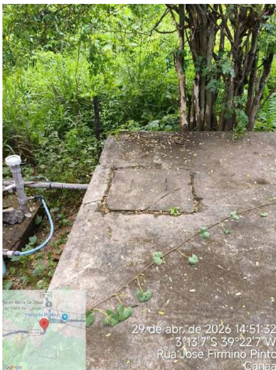
Foto 26 - RSE / EEAT (Canaã): Entrada de inspeção vulnerável às águas de chuva.
