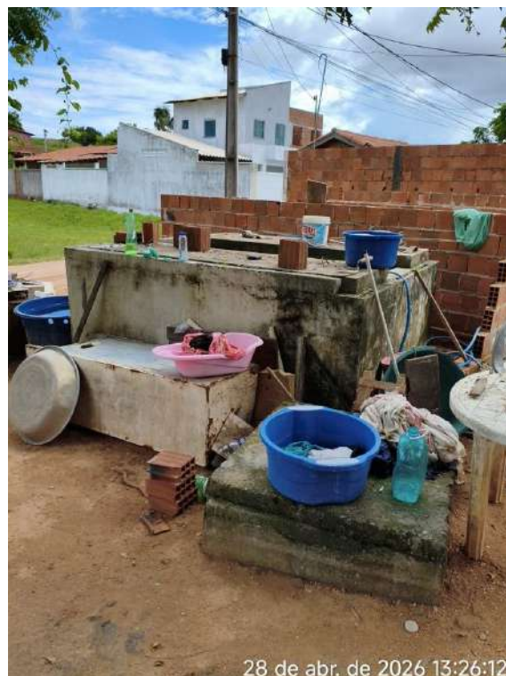
Foto 33 - PT-04 (Flecheiras): Caixa de proteção do poço sem tampa; área sem isolamento perimetral e de segurança.
