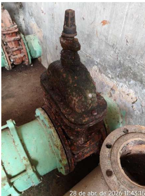
Foto 66 - EEAT-01 / EELF-01 (Trairi): registro em processo corrosivo.
