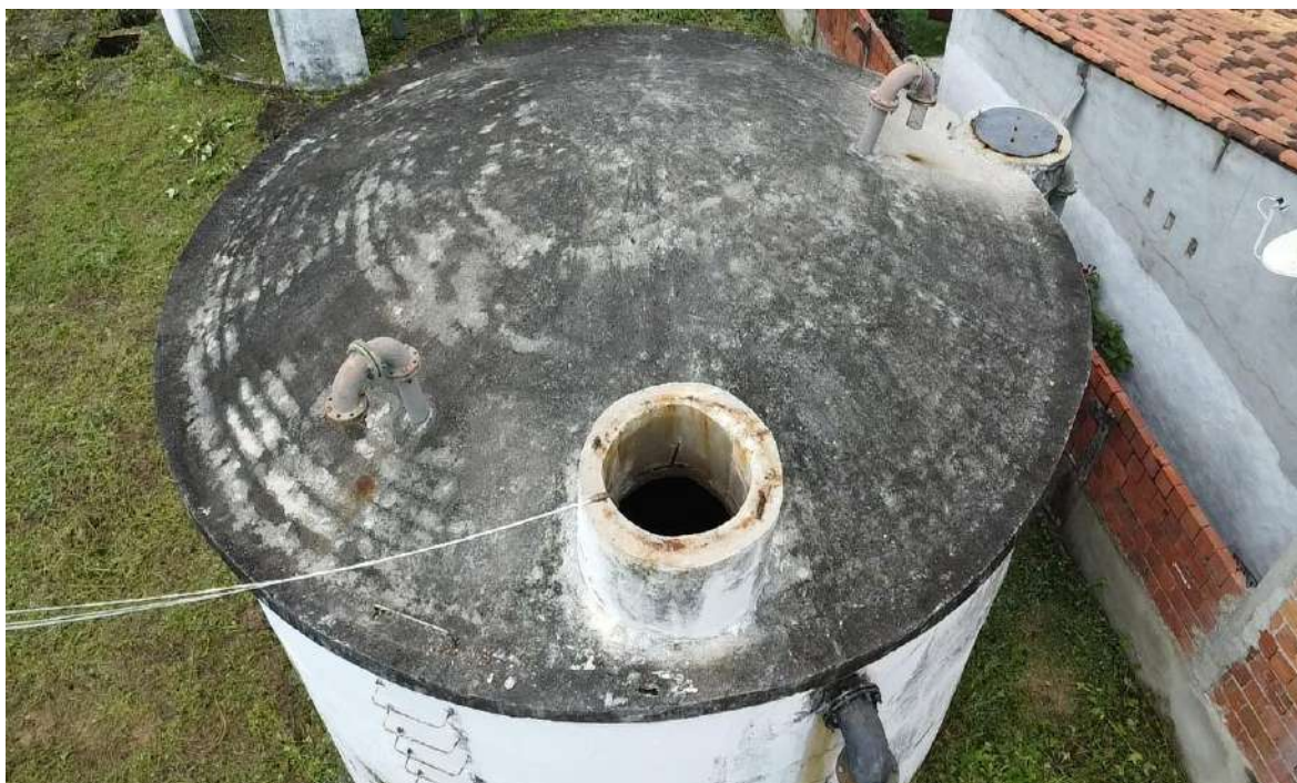
Foto 17 - RAP-02 (Trairi): RAP com escada sem gaiola e grade de proteção no patamar superior / laje de cobertura; falta da tampa na abertura de inspeção; cabeamento através da abertura de inspeção.
