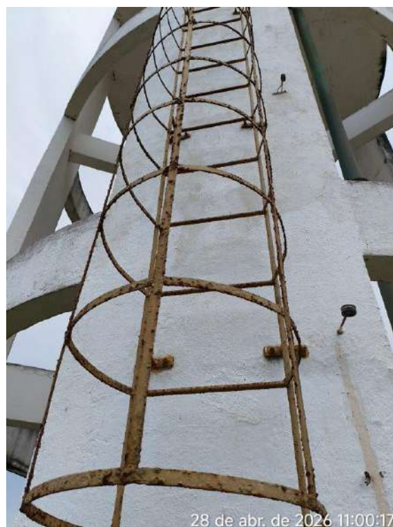
Foto 69 - REL-03 (Trairi): escada em processo de corrosão.
