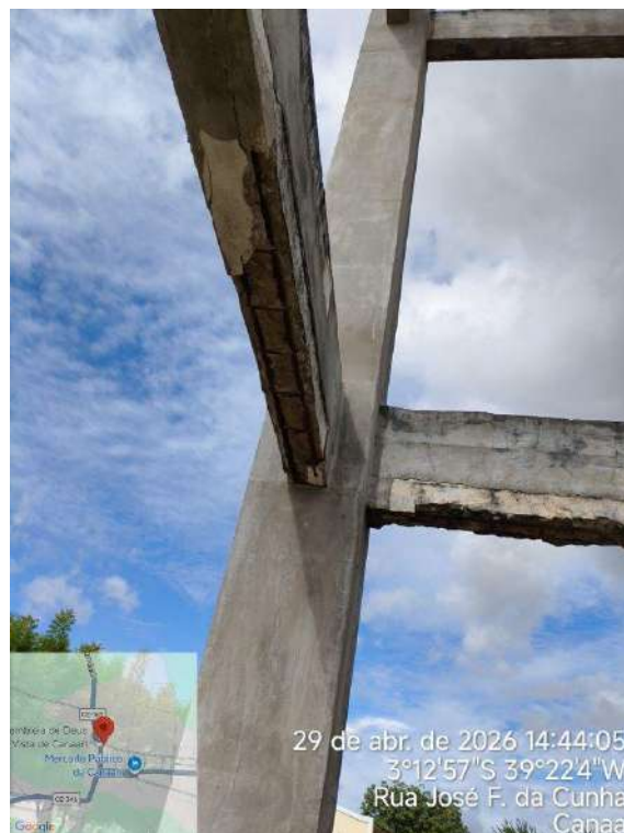
Foto 79 - REL (Canaã): rachaduras e degradação do concreto e ferragens expostas.
