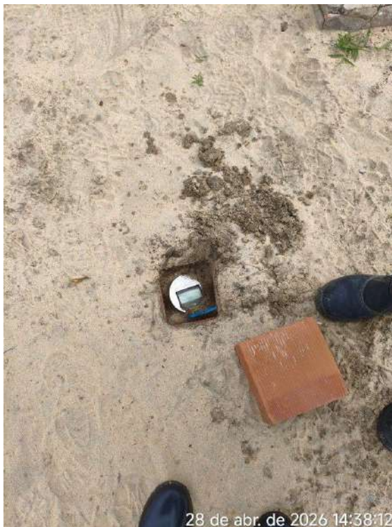
Foto 46 - ETA / Pátio (Mundaú): macromedidor sem caixa de proteção.
