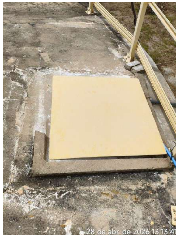
Foto 39 - ETA / RAP-01 ( Flecheiras ): tampa sem fecho hermético, com instalações hidráulicas e elétricas inadequadas.
