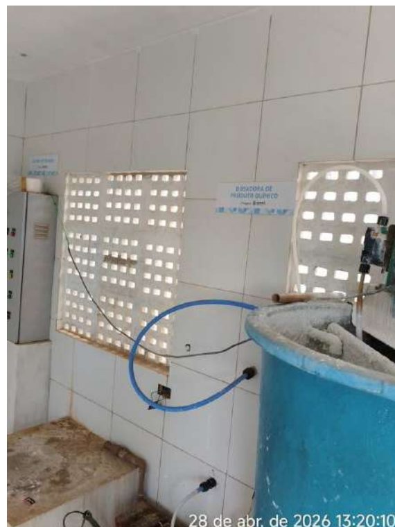
Foto 107 - ETA / Sala de Química (Flecheiras): tomada de energia danificada e fiação exposta.
