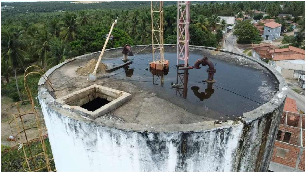
Foto 21 - REL-03 (Trairi): ausência de tampa de inspeção; falta grade de proteção na cobertura; cabeamento sem isolamento de proteção, instalados junto ou fixados a estruturas metálicas (escada e tubos de ventilação).
