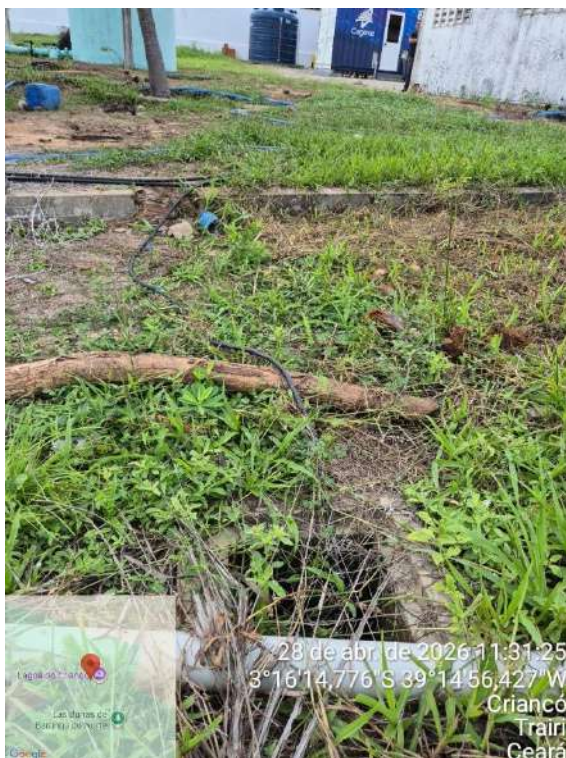
Foto 5 - ETA / Pátio (Trairi): tubulações e conexões expostas e desordenadas, e vegetação, em área de circulação.
