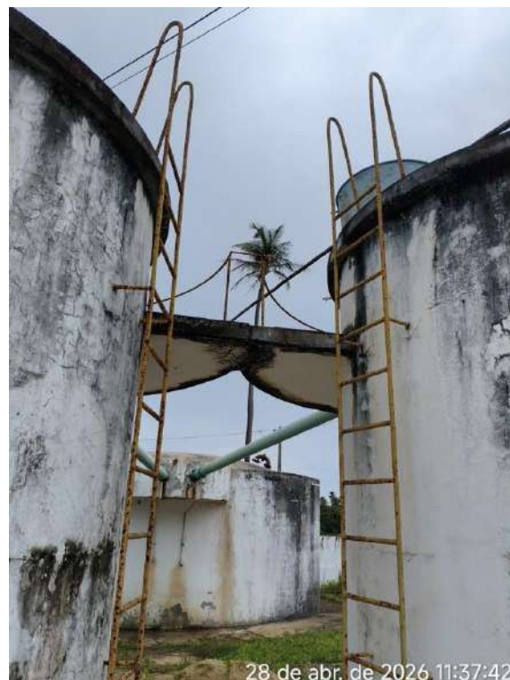
Foto 8 - Filtros (Trairi): escadas inadequadas e corroídas, sem grade de proteção/ guarda-corpo acima do patamar superior.
