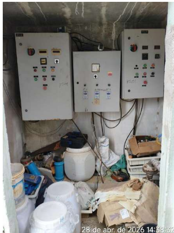
Foto 51 - ETA / EEAT-01 (Mundaú): unidade com materiais e equipamentos armazenados indevidamente.
