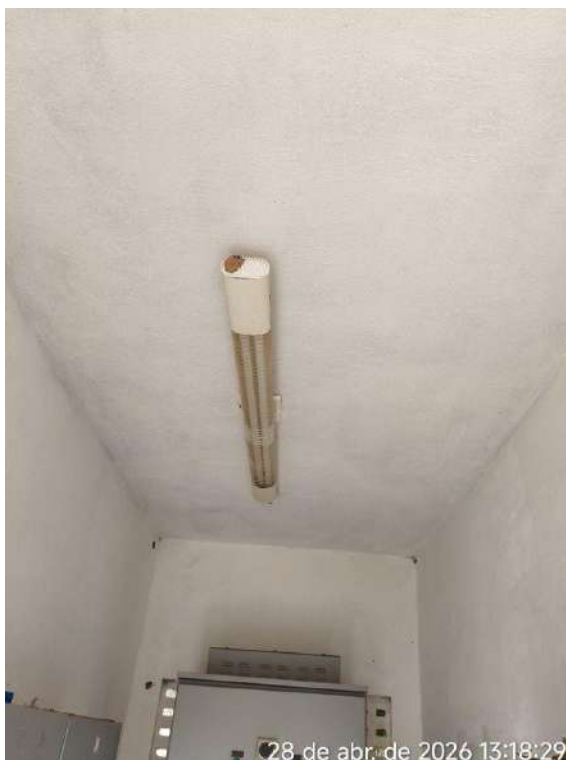
Foto 106 - ETA / EEAT-01 (Flecheiras): lâmpadas queimadas na Sala de Comando.
