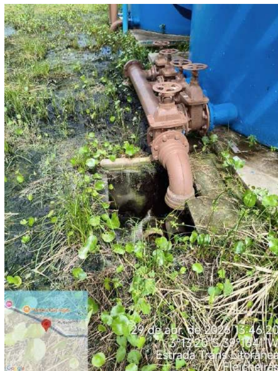
Foto 127 - EEE-01 (Flecheiras): sinais de vazamento e/ou extravasamento de esgotos; caixa sem tampa de proteção.
