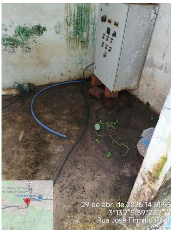
Foto 24 - RSE / EEAT (Canaã): Cabeamento elétrico exposto, sobre o piso e sem isolamento de proteção e quadro sobre tijolos.
