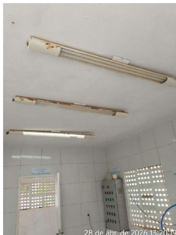
Foto 105 - ETA / Casa de Química (Flecheiras): lâmpadas queimadas na Casa de Química.
