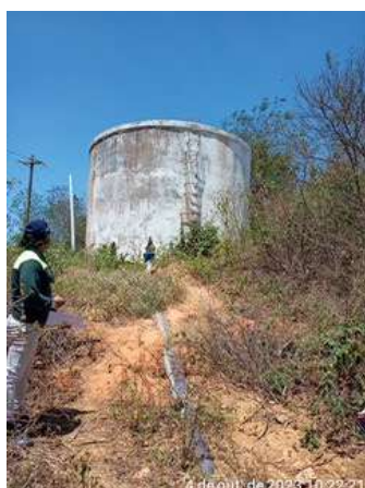
Foto 30 - RAP-02 (Crioulas): acesso difícil e acidentado; sem isolamento e proteção da área que está sendo tomada pelo mato e infraestrutura de ancoragem da adutora deteriorada.
