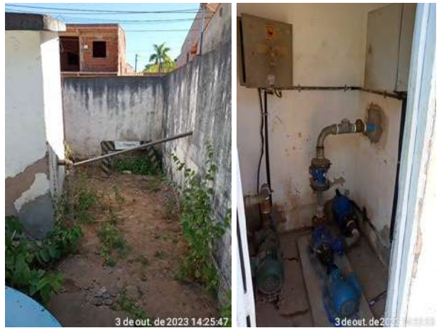
Foto 23 - EEAT-05 / EERD-03 (Sede): Infraestrutura de alvenaria necessitando de reparos e pintura desgastada; área de circulação necessitando de recuperação do pavimento e limpeza da vegetação.
