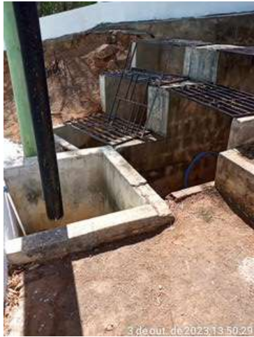
Foto 20 - RAP-02 (Sede): caixas com tampas danificadas.
