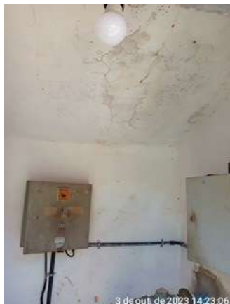
Foto 24 - EEAT-05 / EERD-03 (Sede): Infraestrutura de alvenaria necessitando de reparos e pintura desgastada e lâmpada da casa de bombas não acende.
