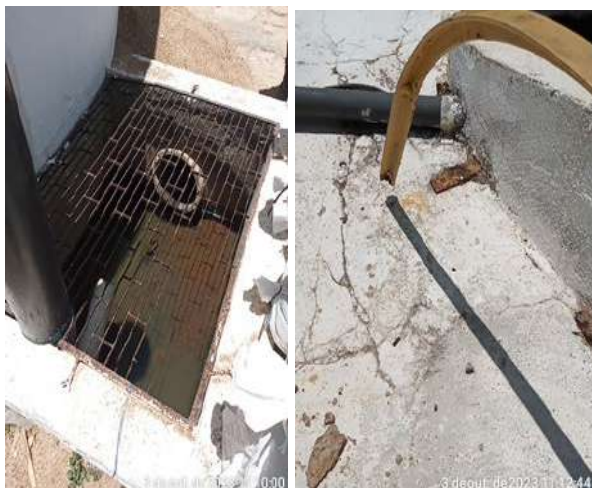
Foto 14 - RAP-01 (Sede): caixa de descarga com água acumulada (drenagem não funciona), escada tipo marinheiro inadequada e com a base de fixação superior danificada.
