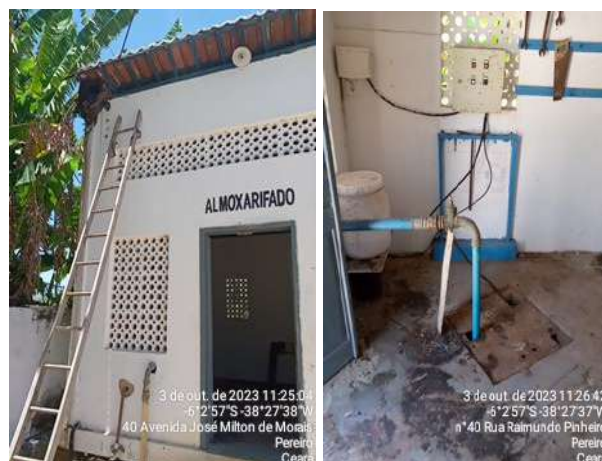
Foto 17 - ETA (Sede): almoxarifado com lâmpada sem funcionar, fiação sem eletroduto e piso sujo necessitando de limpeza; PT desativado sem lacre.
