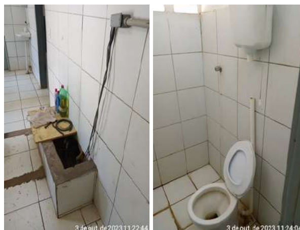
Foto 16 - ETA (Sede): cabo na casa de bombas está sem eletroduto; banheiro com descarga danificada.
