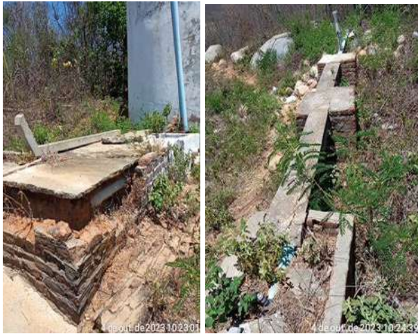
Foto 32 - RAP-02 (Crioulas): infraestrutura de ancoragem da adutora deteriorada; caixa sem tampa; tampa da abertura de acesso e inspeção do reservatório sem fechamento hermético.
