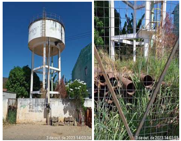
Foto 21 - REL-01 (desativado) (Sede): infraestrutura em completo abandono, com mato crescido, mas servindo de almoxarifado para guarda de tubulação.
