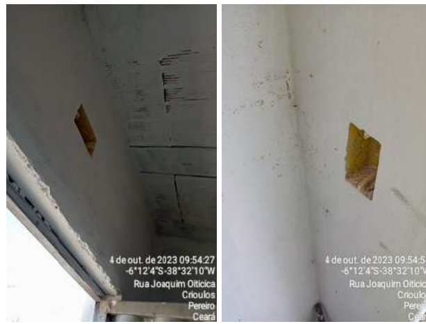
Foto 27 - PT-02 (Crioulas): casa do quadro de comando sem iluminação.
