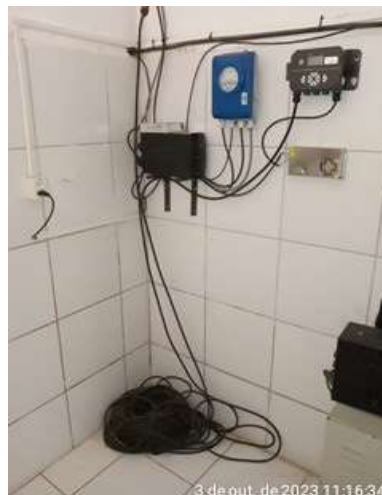
Foto 15 - ETA (Sede): cabo que liga o controle de volume de descarga dos filtros encontra-se com comprimento excedente enrolado no chão.
