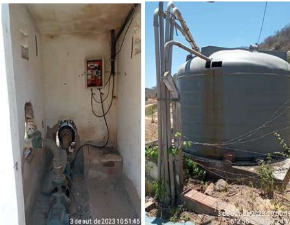
Foto 10 - EEAB-01 / RAP-04 (Sede): infraestrutura em completo abandono, casa de bombas danificada, cerca de isolamento danificada e reservatório com sinais de extravasamento.
