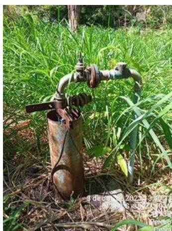
Foto 18 - PT-05 (Sede): sem tampa de proteção do tubo, sem isolamento da área, mato crescido.
