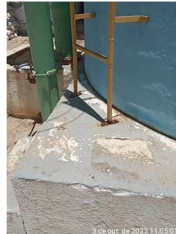
Foto 11 - F-01 (Sede): escada com a base de fixação corroída.
