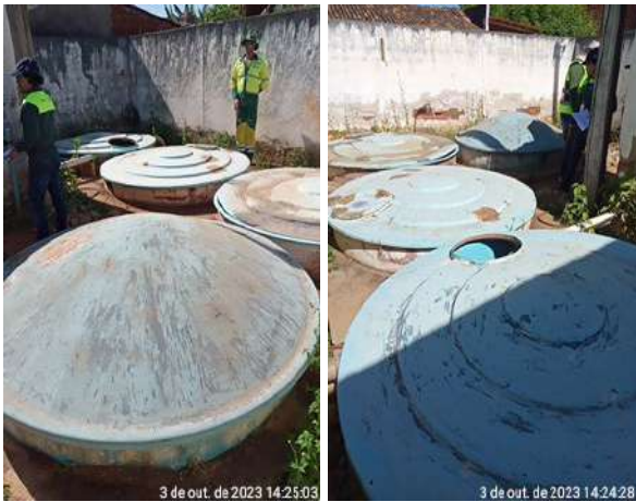
Foto 22 - EEAT-05 / EERD-03 (Sede): reservatórios enterrados necessitando de pintura, sem identificação e com abertura de acesso e inspeção sem tampa; lâmpada da casa de bombas não acende.
