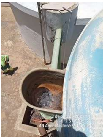
Foto 12 - F-01 (Sede): caixas de saída da água filtrada sem tampas.
