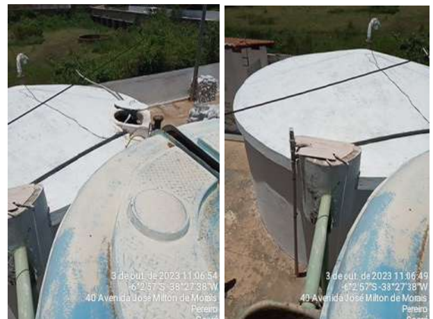
Foto 13 - RAP-01 (Sede): com tampa de inspeção fora do lugar, caixa de entrada de água filtrada com tampa improvisada.
