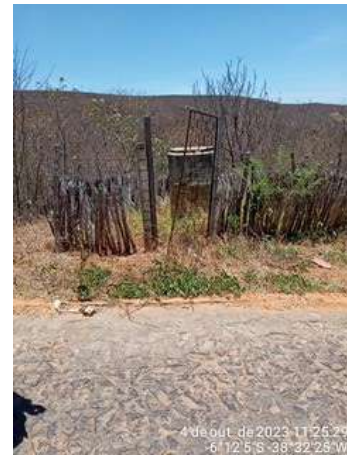
Foto 35 - ONE WAY (Crioulas): Infraestruturas em estado precário de manutenção, com cerca de isolamento e proteção deteriorada.
