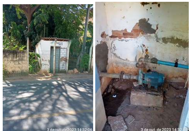
Foto 25 - EEAT-02 / EERD-02 (Sede): Infraestrutura de alvenaria necessitando de reparos nos rebocos e pintura; cerca de isolamento danificada e área tomada por vegetação.
