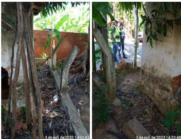
Foto 26 - EEAT-02 / EERD-02 (Sede): Infraestrutura de alvenaria necessitando de reparos nos rebocos e pintura e área tomada por vegetação.
