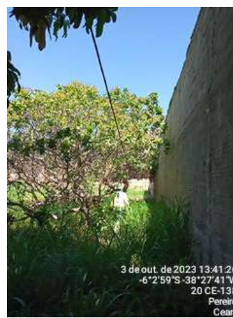
Foto 19 - PT-05 (Sede): instalações elétricas com fiação presa sobre a ação de galhos de árvores e altura baixa.
