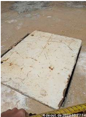
Foto 34 - RAP-02 (Crioulas): tampa da abertura de acesso e inspeção do reservatório sem fechamento hermético.
