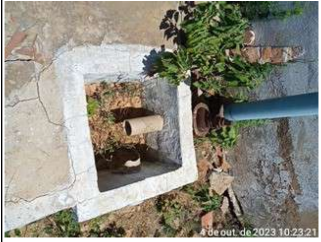
Foto 33 - RAP-02 (Crioulas): caixa sem tampa; tampa da abertura de acesso.
