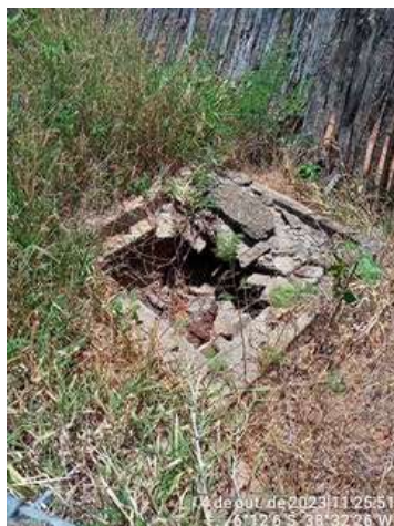
Foto 36 - ONE WAY (Crioulas): caixa com tampa deteriorada.
