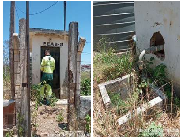
Foto 9 - EEAB-01 / RAP-04 (Sede): infraestrutura em completo abandono, caixa sem tampa de proteção, mato crescido no interior da área de proteção, cerca de isolamento danificada.
