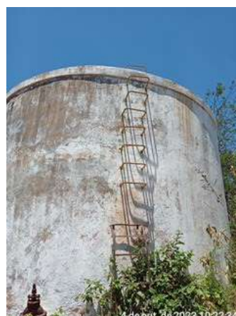
Foto 31 - RAP-02 (Crioulas): escada tipo marinheiro inadequada e reservatório sem ventilação.
