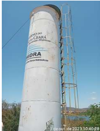
Foto 8 - Torre de equilíbrio (Sede): a infraestrutura em completo abandono com a infraestrutura de proteção e isolamento em estado precário de conservação, cercas e portão de acesso.
