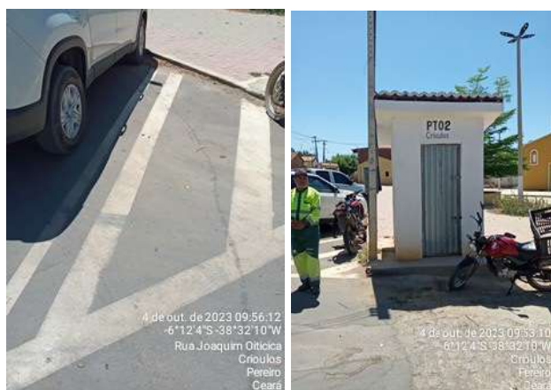
Foto 29 - PT-02 (Crioulas): casa do quadro de comando com material armazenado inadequadamente em seu interior e acesso ao poço foi recoberto com asfalto.
