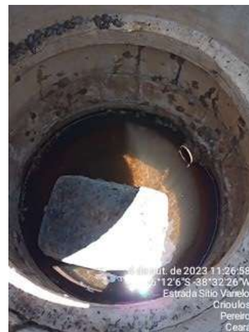
Foto 37 - ONE WAY (Crioulas): dispositivo servindo de moradia para rãs, em contato direto com água tratada.
