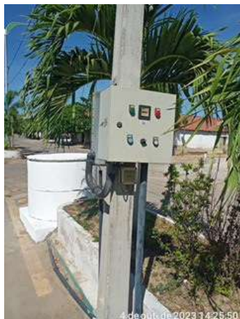
Foto 1 - PT-09: chave do quadro de comando exposta a ação de vandalismo.
