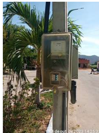
Foto 2 - PT-09: chave do medidor de energia exposta a ação de vandalismo.
