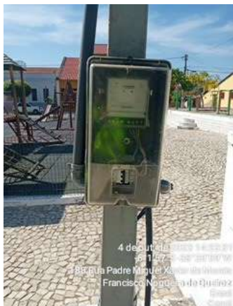
Foto 3 - PT-11: chave do medidor de energia exposta a ação de vandalismo.
