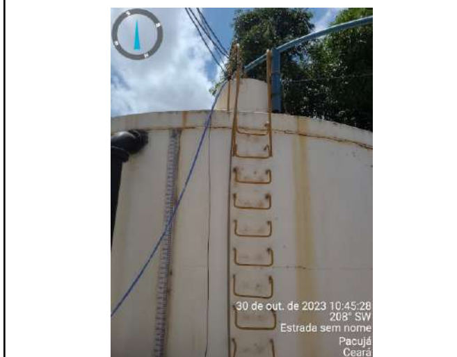
Foto 10 - RAP-01 (ETA): apresenta vazamento, tampa deslocada e corroída, instalações elétricas inadequadas e pintura desgastada.
