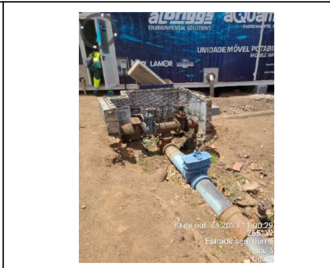
Foto 6 - ETA: caixas de registro/medidor danificadas.
