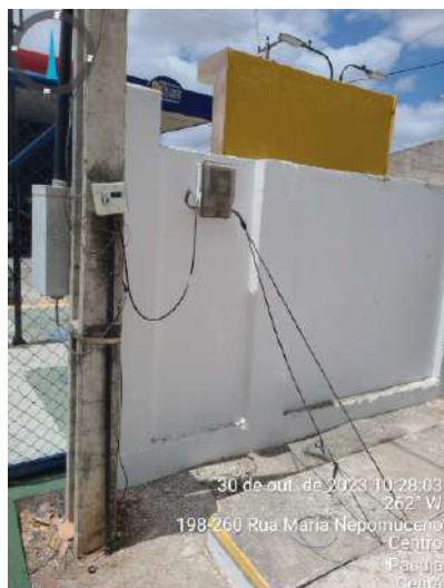
Foto 3 - REL-01/REL-02: instalações elétricas inadequadas
