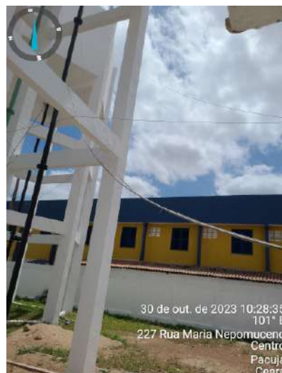
Foto 4 - REL-01/REL-02: instalações elétricas inadequadas.
