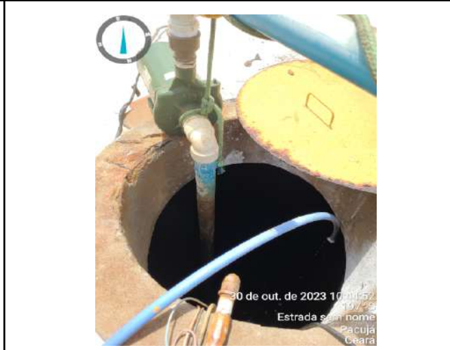
Foto 8 - RAP-01 (ETA): apresenta vazamento, tampa deslocada e corroída, instalações elétricas inadequadas e pintura desgastada.
