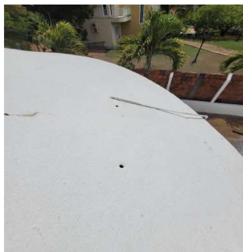
Foto 4 - RAP-1 (Sede): presença de furos na laje.
