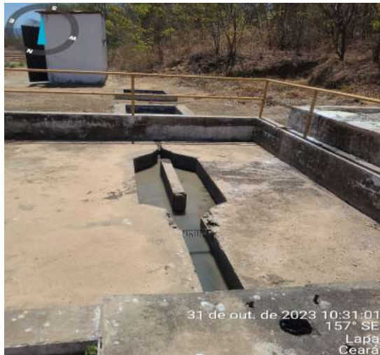
Foto 20 - ETE (Lapa): grade danificada.
