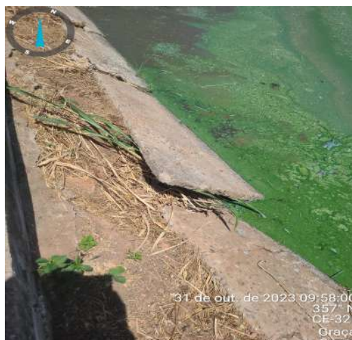
Foto 16 - ETE (Sede): desprendimento das placas de contenção.
