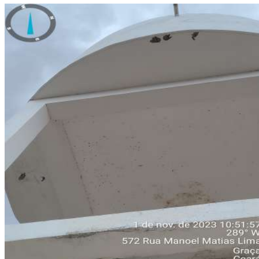
Foto 12 - REL-1 (Sede): pintura desgastada e aço exposto da laje.
