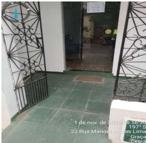
Foto 21- Escritório (Sede): ausência de acessibilidade.
