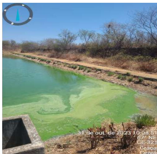
Foto 15 - ETE (Sede): lagoa de maturação com excesso de sobrenadante.
