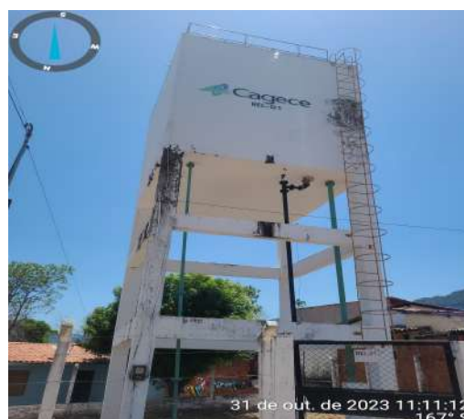
Foto 10 - REL-1 (Lapa): pintura desgastada e sinalizador de nível de garrafa PET.
