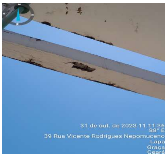
Foto 13 - REL-1 (Lapa): viga em concreto armado com aço aparente.
