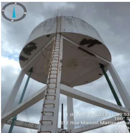
Foto 11 - REL-1 (Sede): pintura desgastada e aço exposto da laje.
