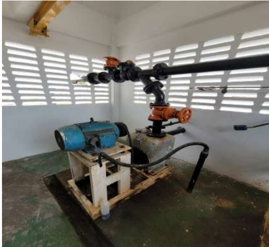
Foto 17 - EEE-2 (Sede): bomba reserva sem funcionar.
