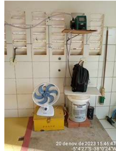
Foto 30 - PAC: instalações precárias e inadequadas.
