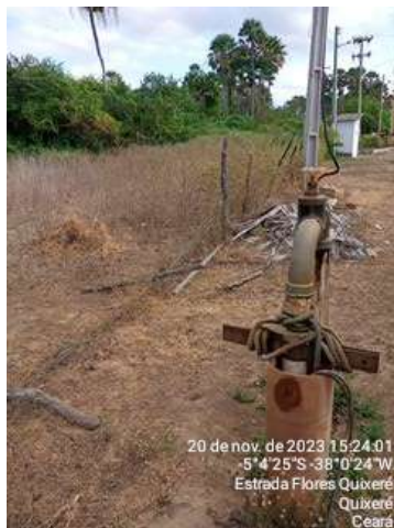
Foto 13 - PT-10: sem laje de proteção, cerca danificada, cabo elétrico desprotegido instalado sobre o solo.
