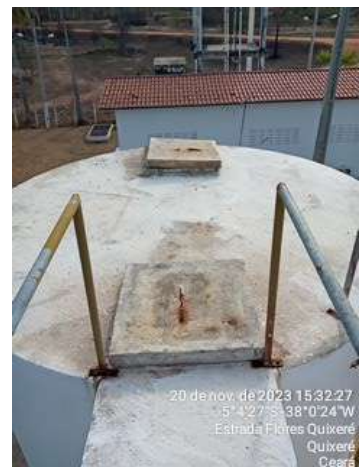
Foto 22 - F-01 e F-02: guarda-corpo incompleto e com base de sustentação em processo de corrosão.
