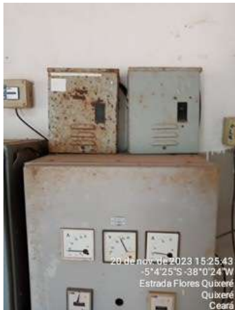
Foto 19 - Casa dos Quadros de Comandos: cabo elétrico desprotegido sobre o piso; quadros em situação precária de manutenção e apresentando processo corrosivo.
