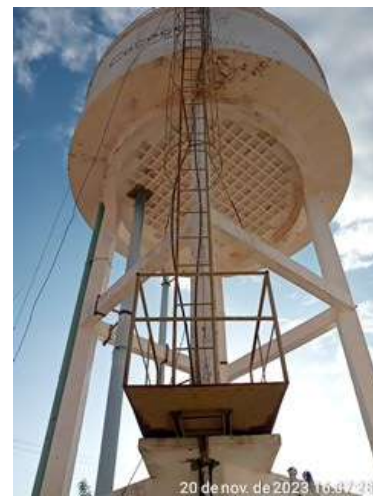
Foto 34 - REL-01: cabos elétricos inadequados; primeiro patamar em processo de corrosão.
