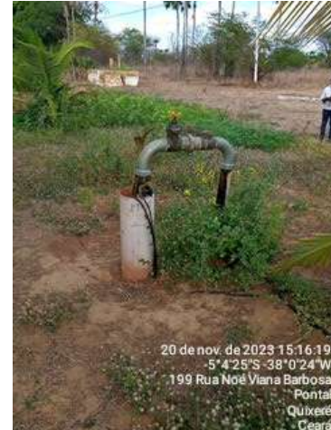
Foto 10 - PT-12: não possui laje de proteção, fiação sobre o solo e vazamento na tubulação de recalque.
