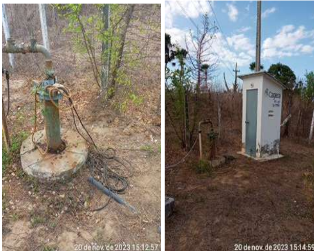
Foto 9 - PT-02: laje danificada com rachadura, fiação elétrica sobre o solo.
