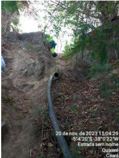
Foto 7 - PT-08: acesso difícil e acidentado ao poço, cabo elétrico de alimentação encontra-se desprotegido.
