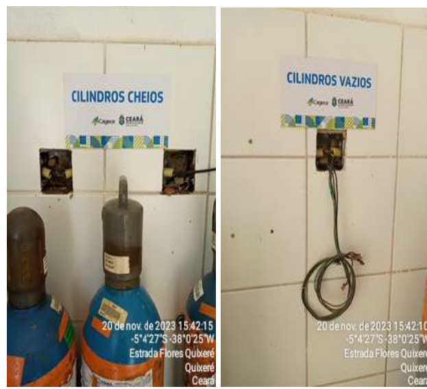
Foto 6 - Casa de Cloro: caixas de passagens elétricas sem tampas.
