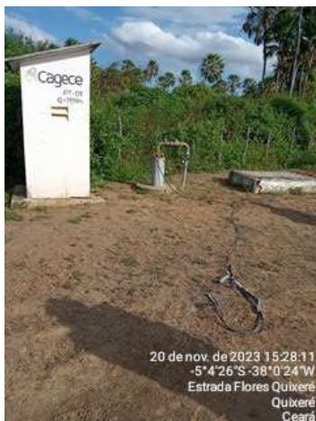
Foto 21 - PT-03: cabo elétrico desprotegido sobre o solo.
