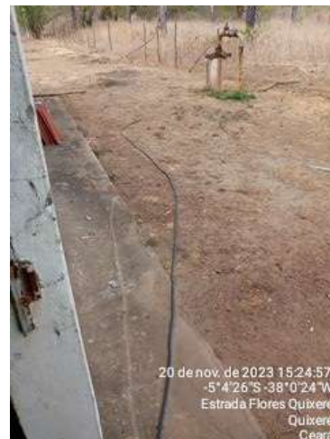
Foto 14 - PT-10: sem laje de proteção, cabo elétrico desprotegido instalado sobre o solo e piso da casa de comando.
