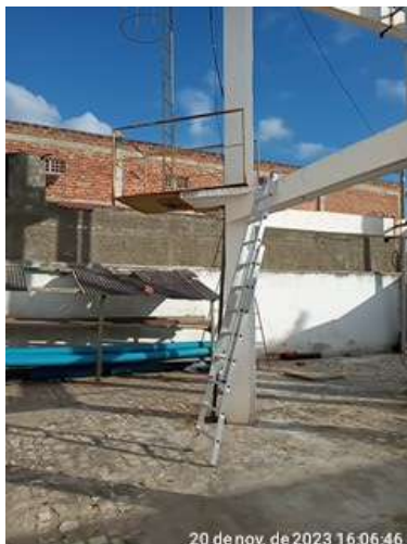
Foto 35 - REL-01: escada de acesso ao primeiro patamar improvisada e primeiro patamar em processo de corrosão.
