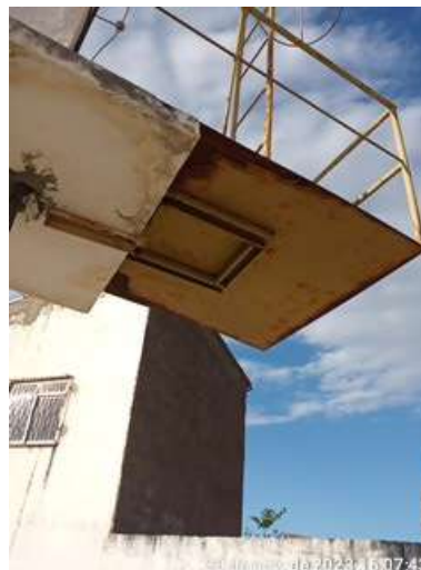
Foto 36 - REL-01: primeiro patamar em processo de corrosão.
