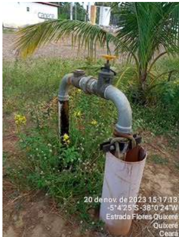
Foto 11 - PT-12: não possui laje de proteção, fiação sobre o solo e vazamento na tubulação de recalque.
