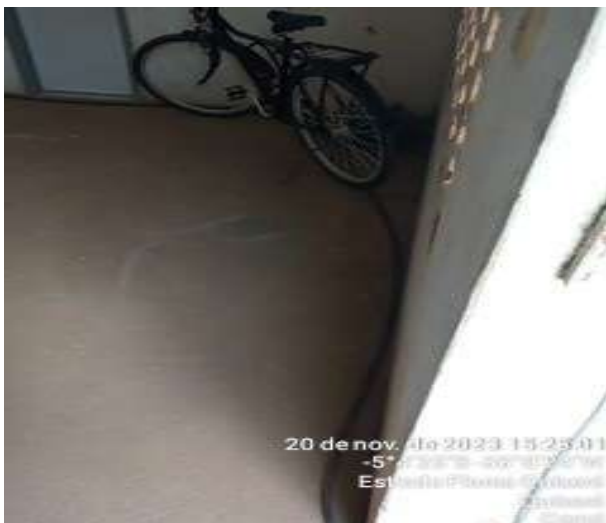
Foto 15 - PT-10: cabo elétrico desprotegido instalado sobre o solo e piso da casa de comando
