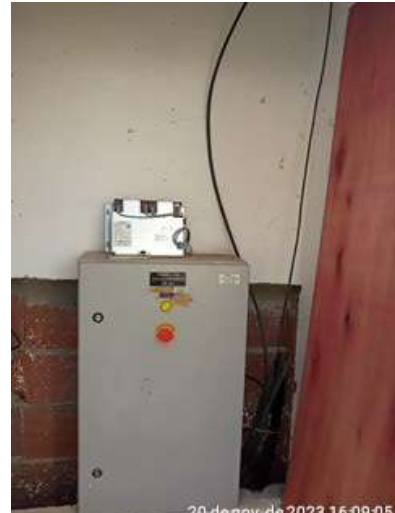
Foto 32 - REL-01: cabos elétricos inadequados.
