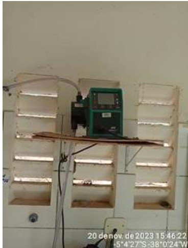
Foto 29 - PAC: instalações precárias e inadequadas.
