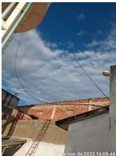
Foto 33 - REL-01: cabos elétricos inadequados.
