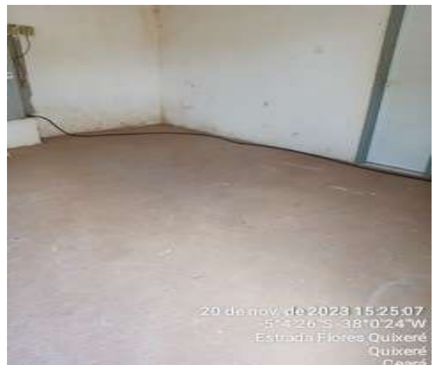
Foto 16 - PT-10: cabo elétrico desprotegido instalado sobre o solo e piso da casa de comando.
