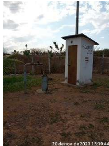
Foto 12 - PT-01: fiação sobre o solo.
