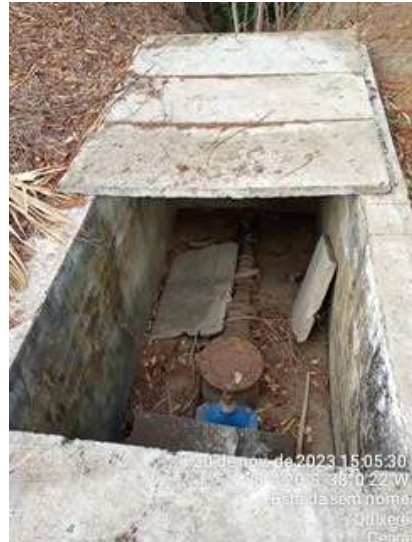
Foto 8 - PT-08: caixas de registro e válvula de retenção com tampas deterioradas.
