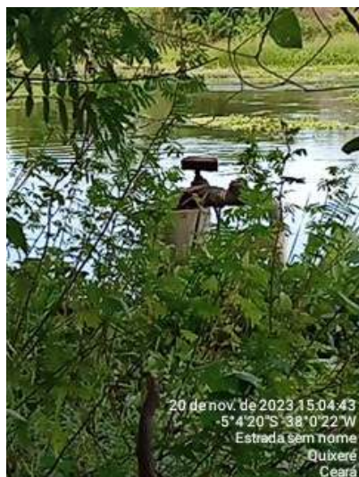
Foto 1 - PT-08: ausência de identificação e sem tamponamento.
