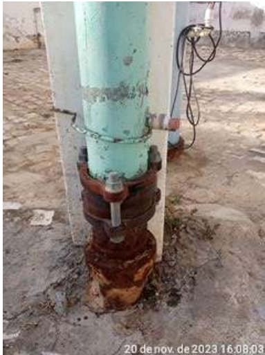
Foto 31 - REL-01: base da tubulação do extravasor em processo de corrosão, cabos elétricos inadequados.
