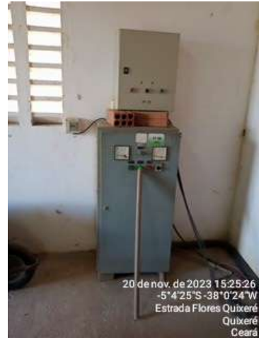
Foto 18 - Casa dos Quadros de Comandos: cabo elétrico desprotegido sobre o piso; quadros em situação precária de instalação e manutenção e apresentando processo corrosivo.
