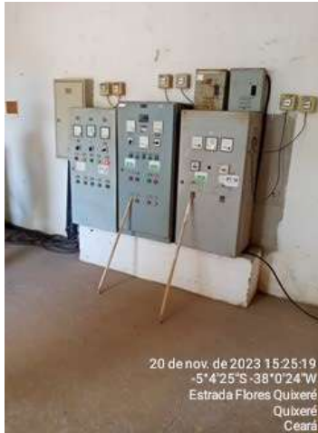
Foto 17 - Casa dos Quadros de Comandos: cabo elétrico desprotegido sobre o piso; quadros em situação precária de instalação e manutenção e apresentando processo corrosivo..
