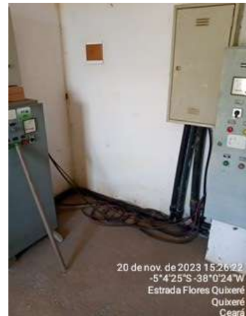
Foto 20 - Casa dos Quadros de Comandos: cabo elétrico desprotegido sobre o piso; quadros em situação precária de manutenção e apresentando processo corrosivo.
