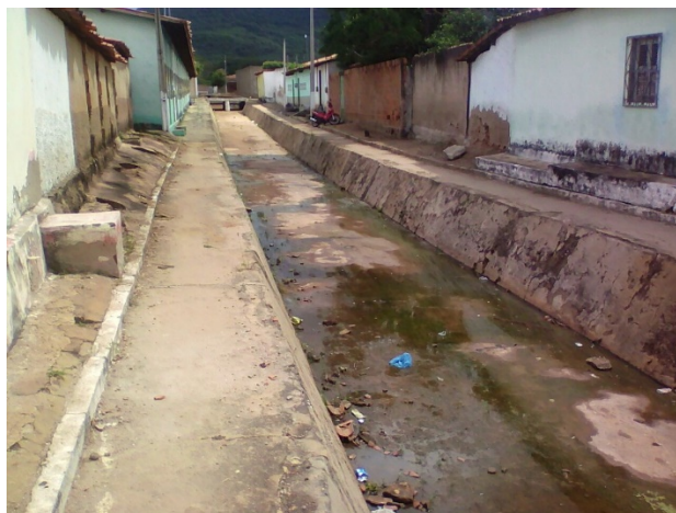
Figura 4.9 - Canal de macrodrenagem recebendo esgotos
