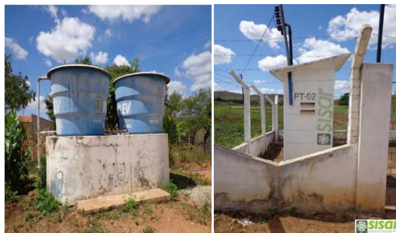
Figura 4.20 – Reservatório de 5m 3 (cada) e Captação no PT 02 do SAA do Distrito de Engenho Velho.
