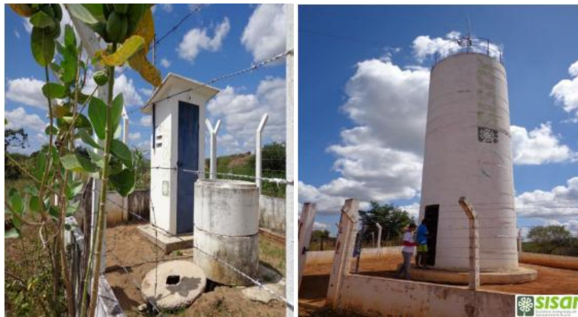
Figura 4.19 – Captação PT 01 e Reservatório Elevado do SAA da zona urbana do Distrito de Engenho Velho.
