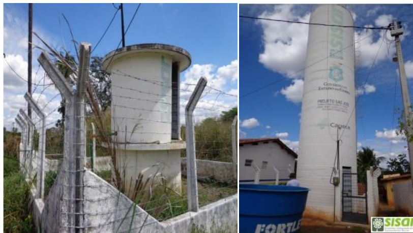
Figura 4.22 – Captação no PA e Reservatório Elevado do SAA da zona urbana de Monte Alegre.
