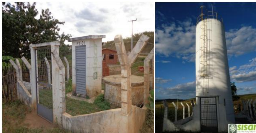
Figura 4.17 – Captação do PT e Reservatório Elevado de Brejinho.
