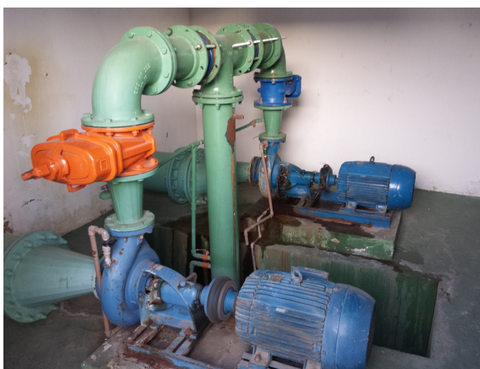
Figura 5.9: Conjunto moto-bomba da EEAT-01.
