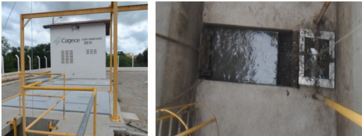
Figura 5.24: Estação elevatória de esgoto (EEE-H2) com tratamento preliminar por gradeamento.
