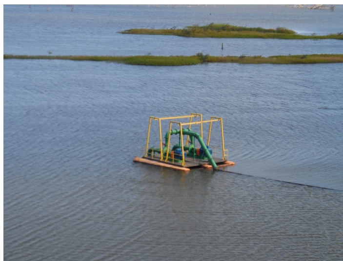
Figura 5.7: Conjunto moto-bomba da captação flutuante no Açude Carnaubal.
