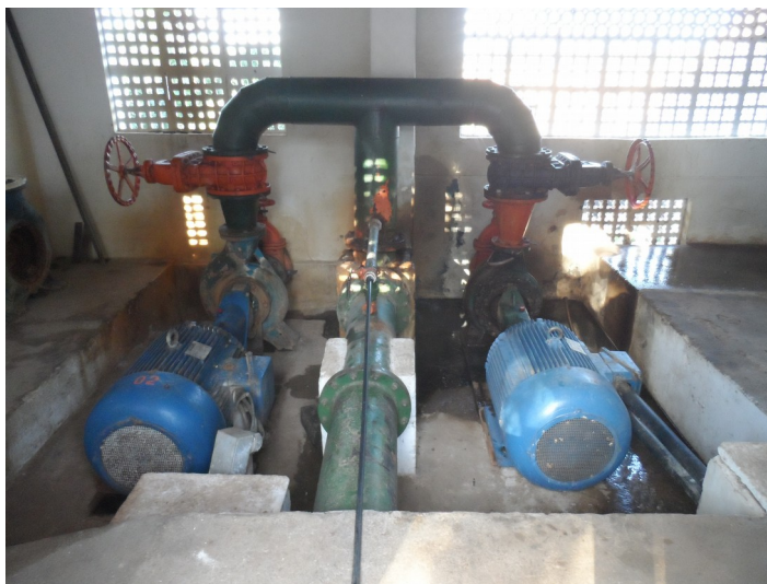
Figura 5.6: Conjunto moto-bomba da captação afogada na Barragem Poty.
