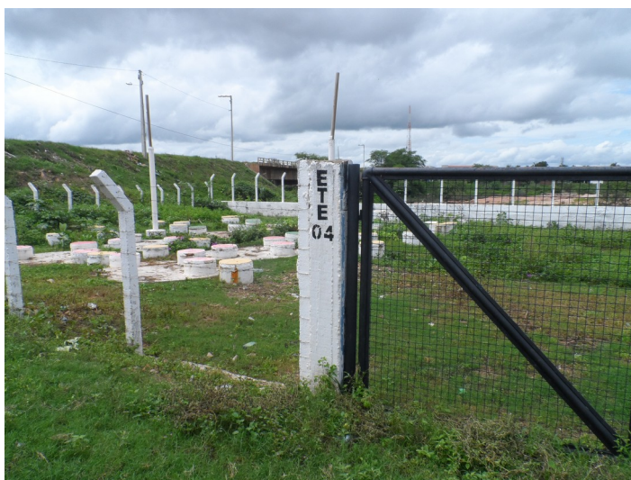
Figura 5.30: Decanto digestor/Filtro anaeróbio – ETE-04.
