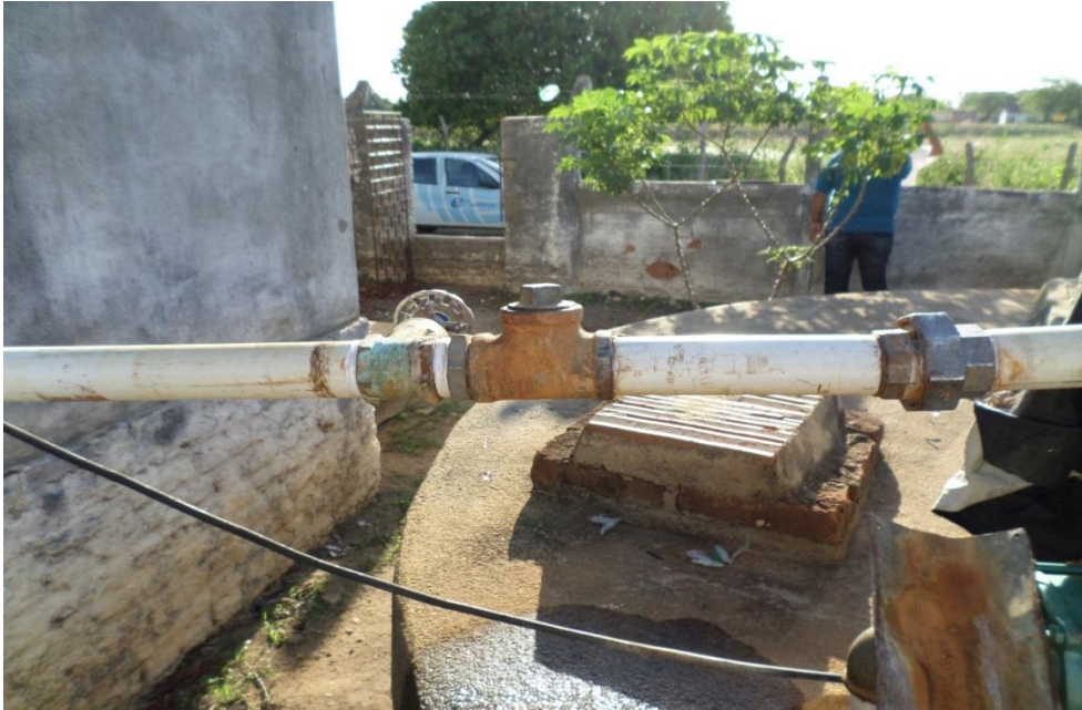
Figura 5.38: Vazamento da tubulação de captação de água do distrito de Santo Antonio.
