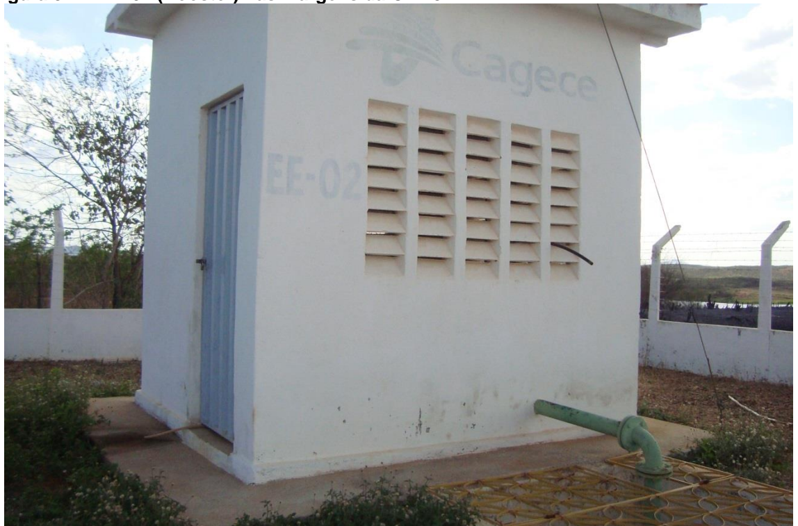
Figura 5.42: EE-02 (Booster) nas margens da CE 284.
