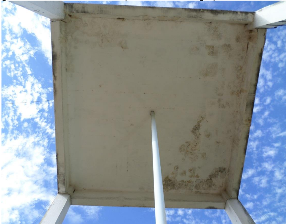
Figura 5.41: Reservatório Elevado (Fundo da Caixa d'água)
