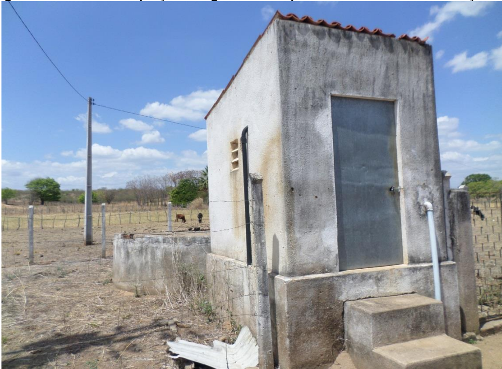
Figura 5.55: Casa de Captação de água doce inoperante no Distrito de Assunção.
