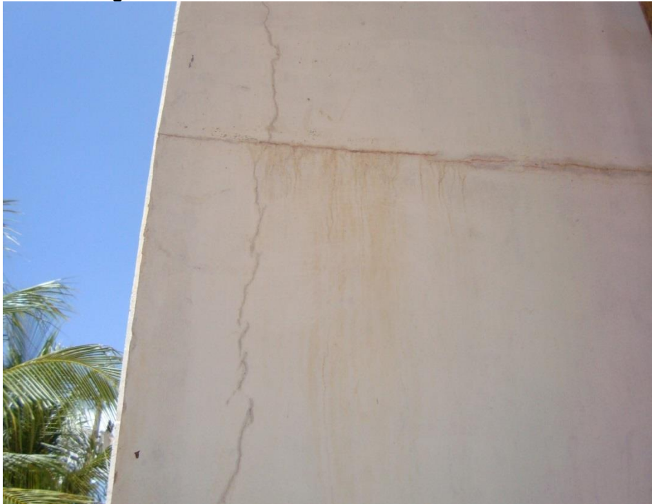
Figura 5.25: Problemas na estrutura do Floculador
