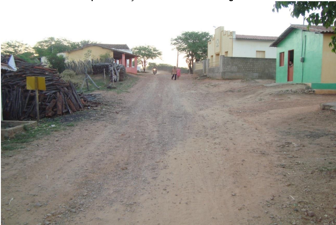
Figura 8.18: Rua da Associação de Moradores de Lagedo demonstrando a ausência de pavimentação e de sistema de drenagem.
