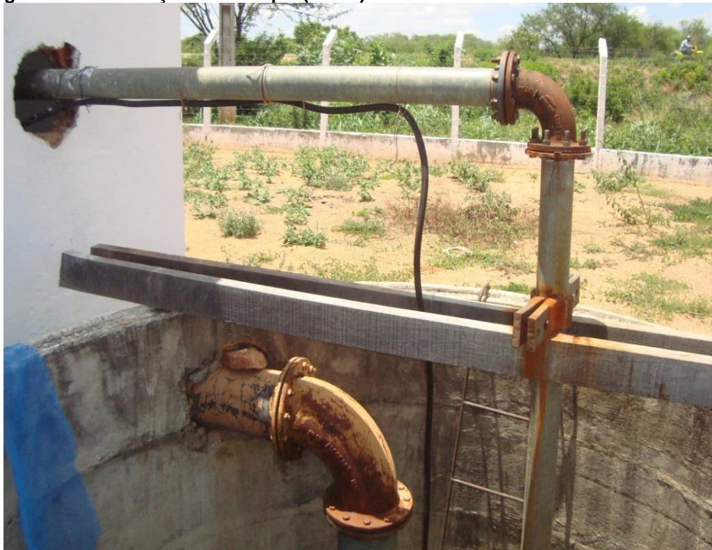
Figura 5.18: Tubulação de recalque (EE 03)
