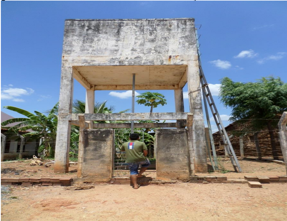
Figura 5.58: Reservatório Elevado no Distrito de Assunção
