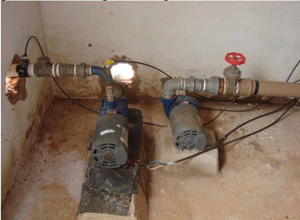
Figura 5.50: Bombas Centrífugas da ETA de Agrovila
