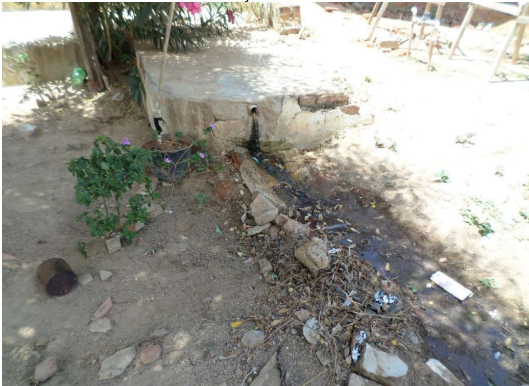
Figura 6.21: Lançamento de efluentes domésticos em via pública no Distrito de Assunção
