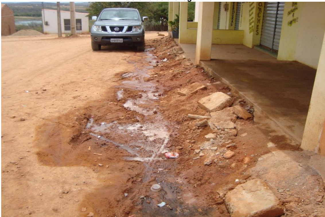
Figura 8.19: Situação atual das vias do Distrito de São Miguel com a ausência de um sistema de drenagem
