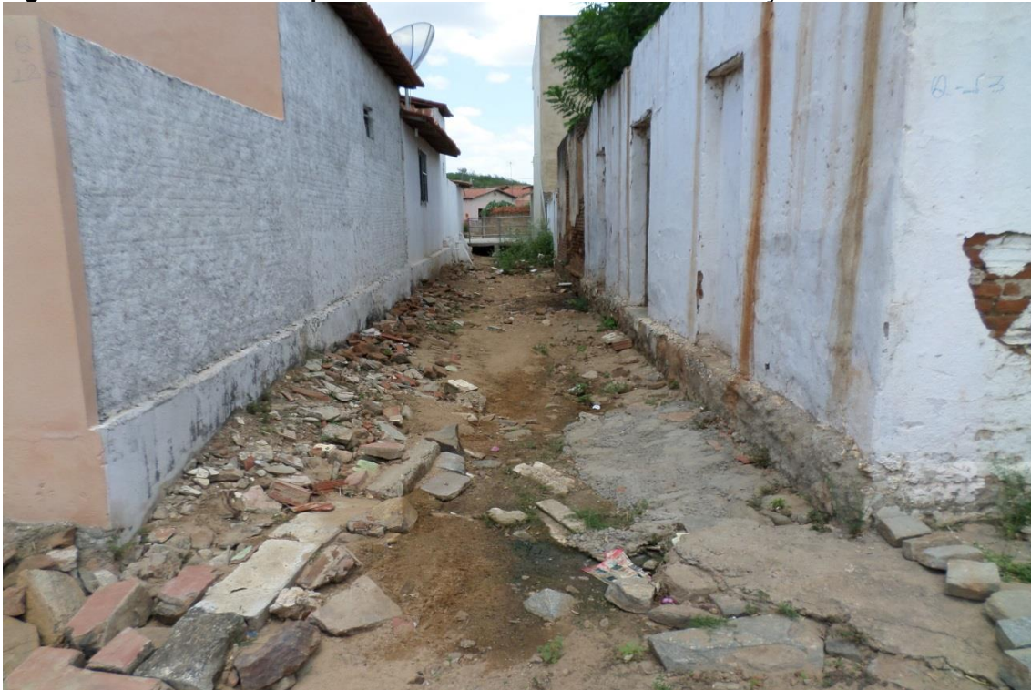
Figura 8.12: Erosão da via pública no distrito de Várzea da Conceição
