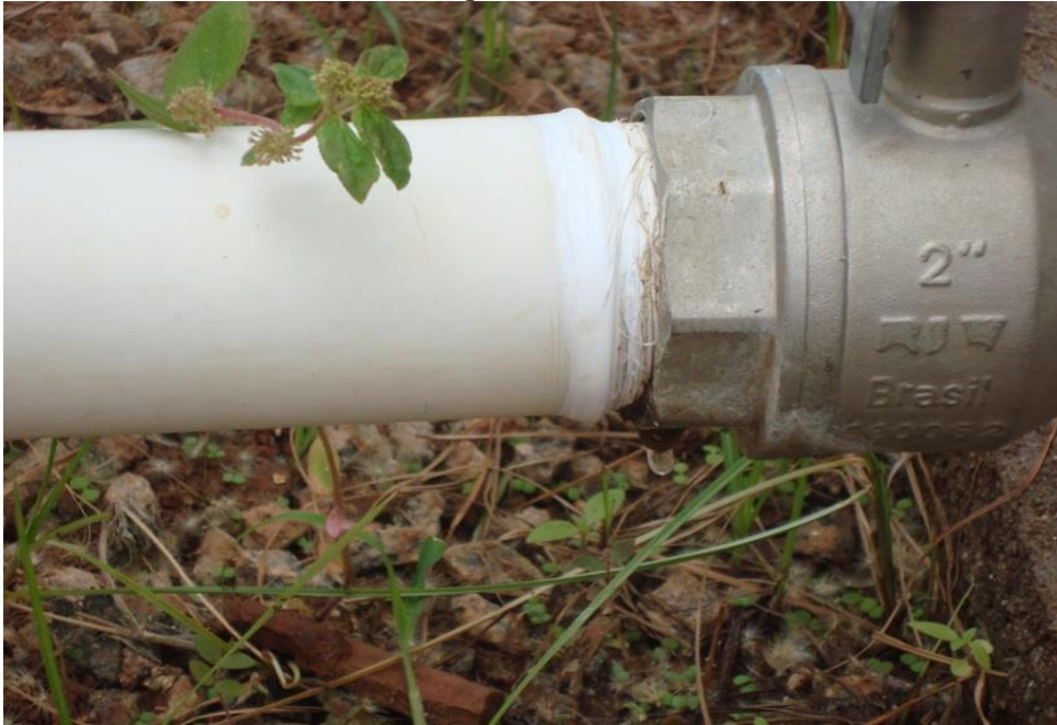
Figura 5.51: Vazamento das tubulações da ETA do Distrito de São Miguel – Agrovila
