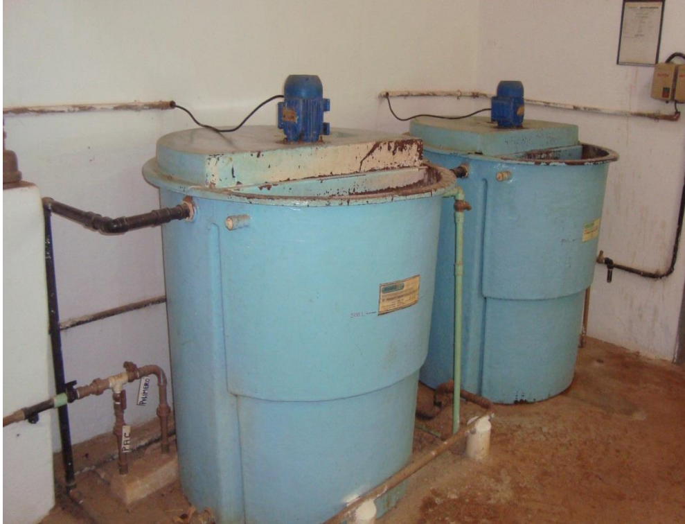
Figura 5.24: Misturador para a adição de PAC da ETA de Cedro
