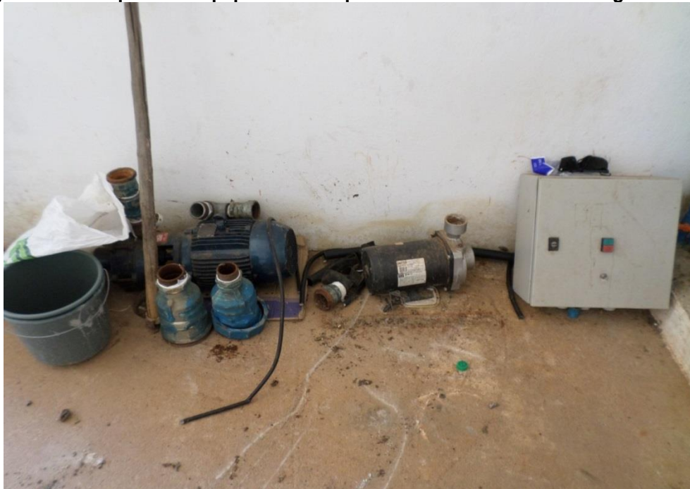
Figura 5.31: Maquinas e Equipamento Inoperantes na ETA-EEAT em Angico II
