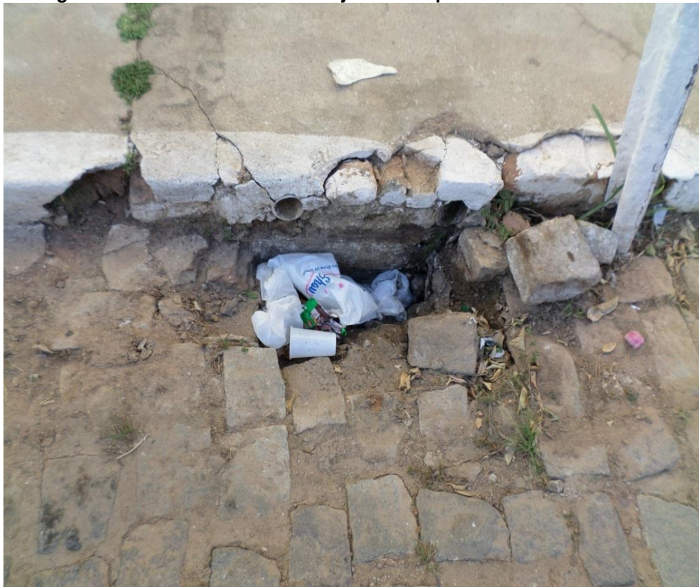
Figura 7.8: Acúmulo de lixo na sarjeta da via pública em Cedro
