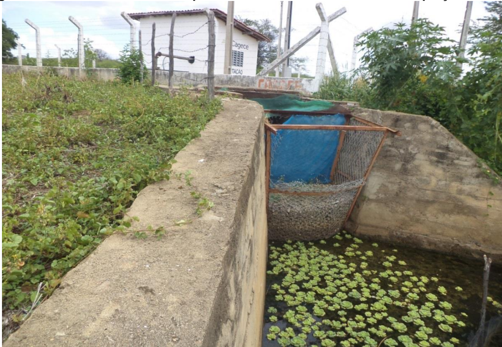
Figura 5.14: Caixa de tratamento preliminar utilizado no sistema de captação
