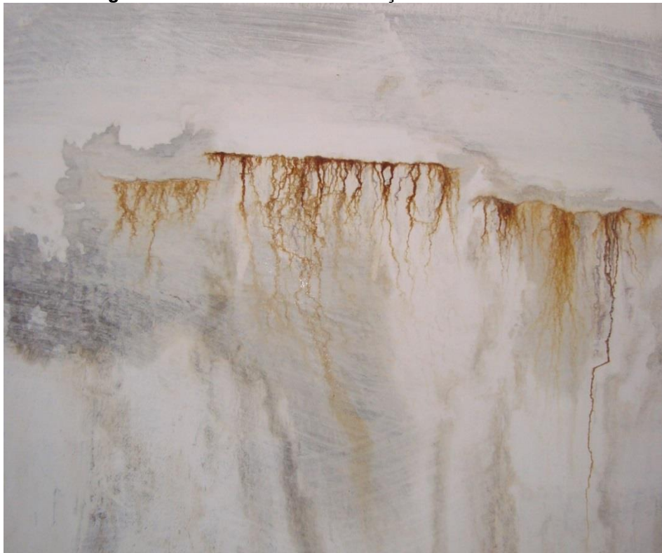
Figura 5.26: Problemas de Infiltração no Floculador
