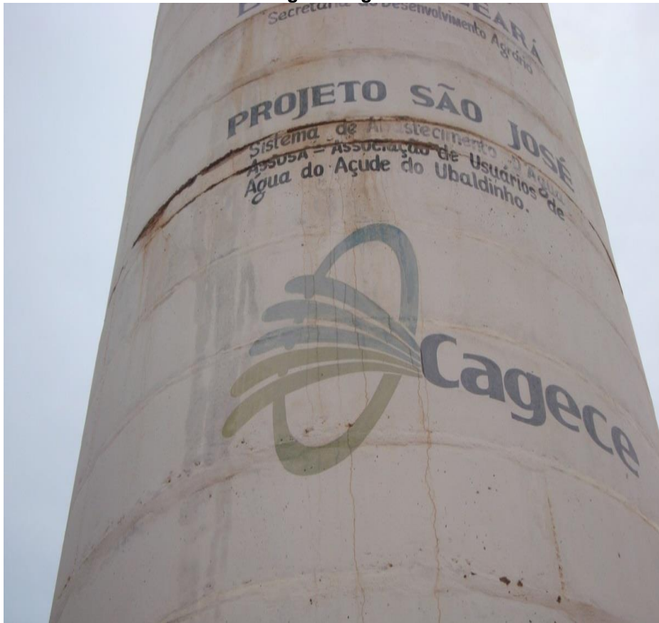
Figura 5.54: Rachaduras na Reservatório Elevado (RELAT) em operação do Distrito de São Miguel – Agrovila
