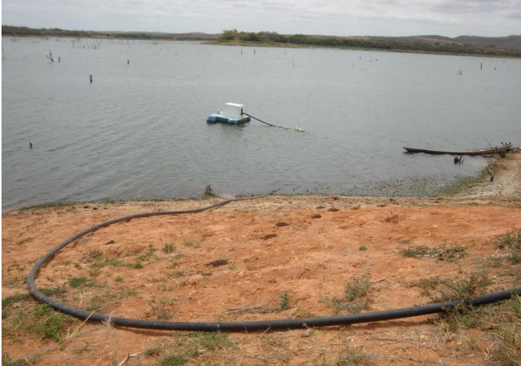
Figura 5.47: Sistema de captação de água utilizado para abastecer o Distrito de São Miguel
