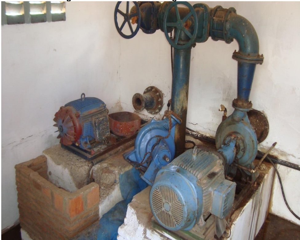
Figura 5.16: Bombas centrífugas da EE 03
