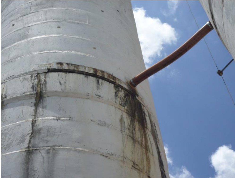
Figura 5.33: Danos visíveis da estrutura externa do reservatório elevado (Torres gêmeas)
