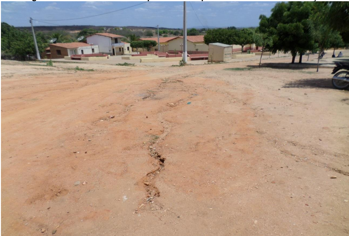
Figura 8.22: Indícios de erosão pluvial na via pública do Distrito de Assunção
