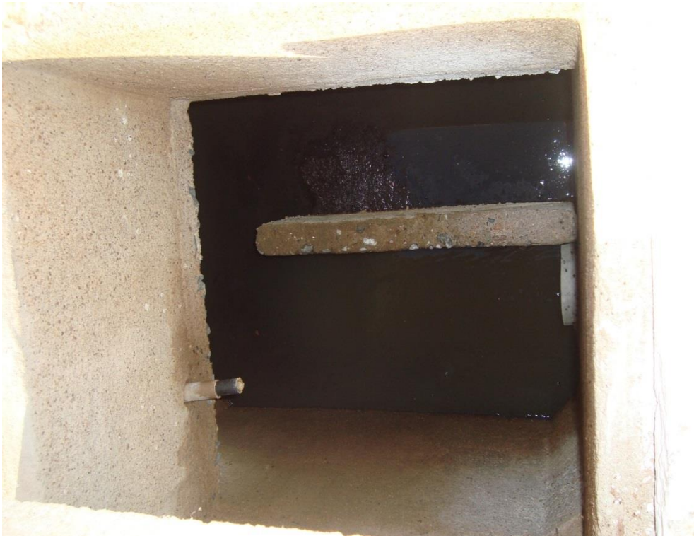
Figura 6.4: Chicanas utilizadas no tratamento do Efluente na ETE
