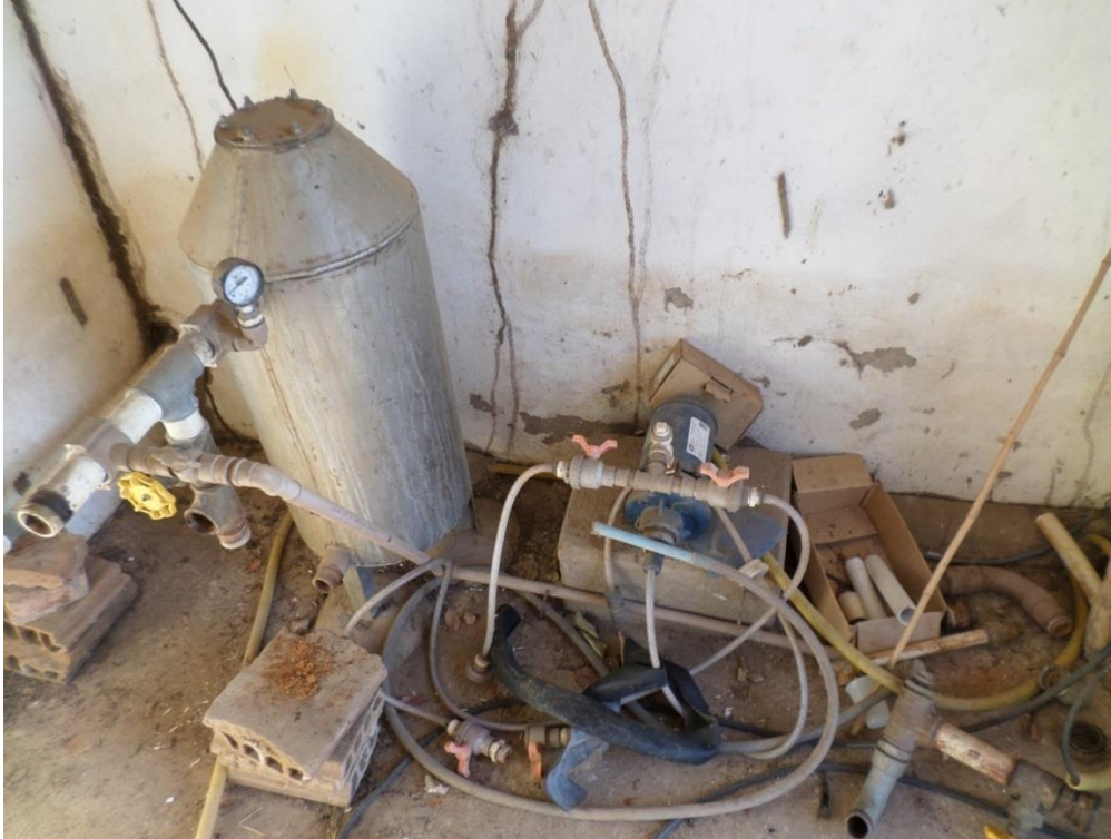
Figura 5.36: Casa de captação (Equipamento) do distrito de Santo Antônio.
