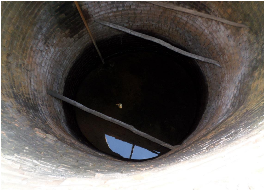
Figura 5.39: Poço Amazonas (Cacimbão) utilizado como fonte de água para abastecimento do distrito de Santo Antonio
