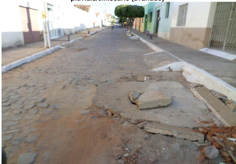
Figura 8.5: Irregularidades no Poço de manutenção da galeria de águas pluviais/emissário (avariado)
