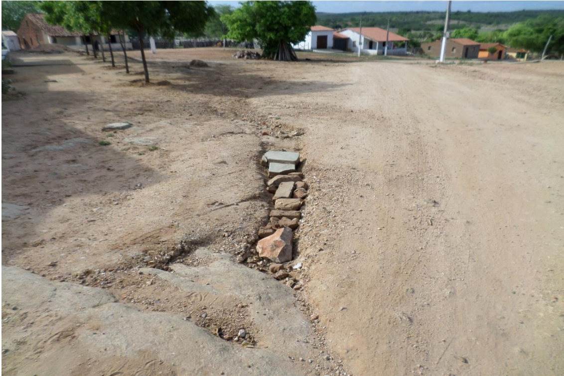
Figura 8.15: Via principal sem pavimentação e com Indícios de erosão pluvial no distrito de Santo Antônio
