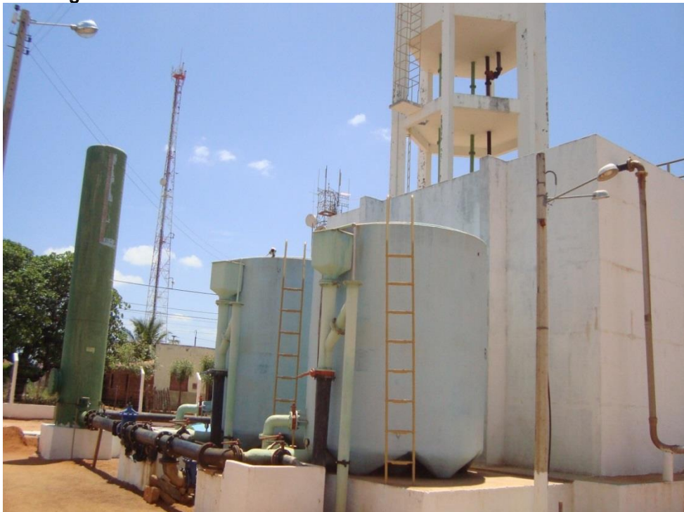
Figura 5.22: Floculador-Decantador e Filtro da ETA de Cedro
