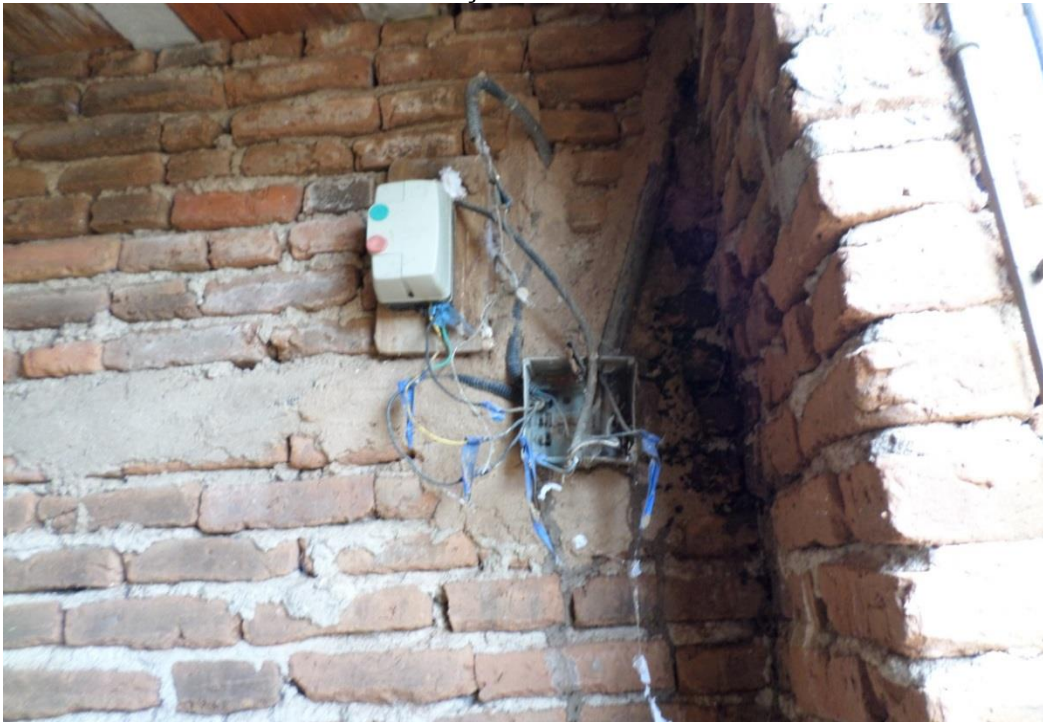
Figura 5.59: Sistema Elétrico da Casa de captação no Sítio Barreiras, Distrito de Assunção.
