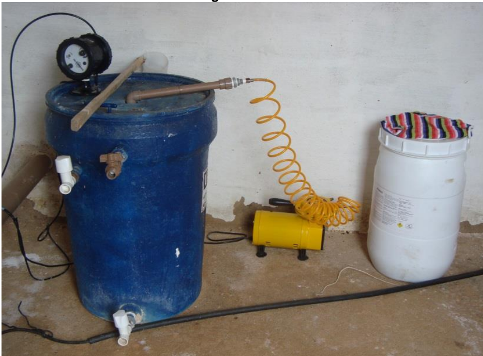
Figura 5.52: Dosadora de Cloro Danificada da ETA do Distrito de São Miguel – Agrovila
