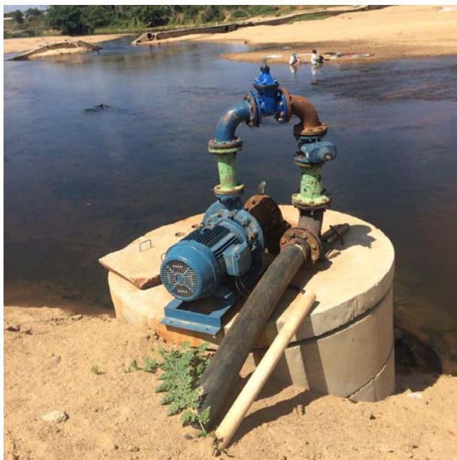
Figura 4.2 - Captação com poço Amazonas no rio Acaraú
