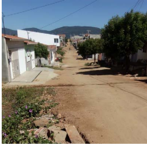
Figura 4.10 - Rua sem Pavimentação na sede urbana com erosão
