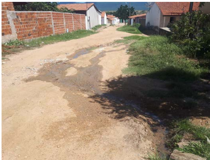
Figura 4.4 - Esgoto a céu aberto na rua Francisco Moreira Chaves – Caixa D'água
