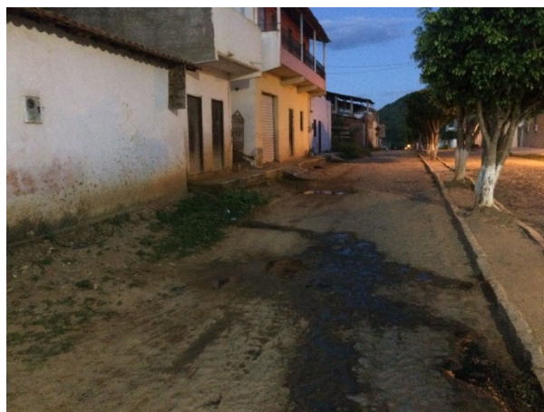
Figura 4.3 - Esgoto a céu aberto na rua: Antônio Alves Guerra - Bairro Vila Dizio
