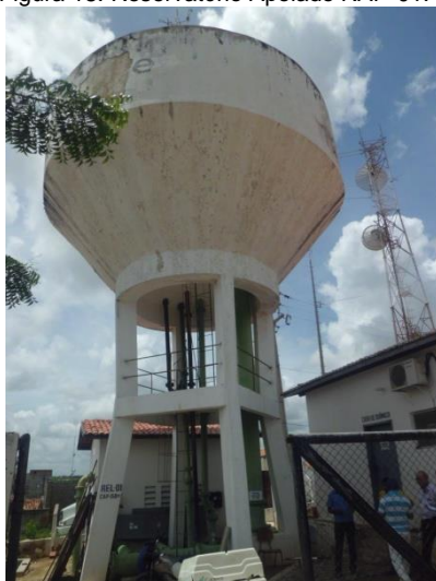
Figura 20: Reservatório Elevado REL.
