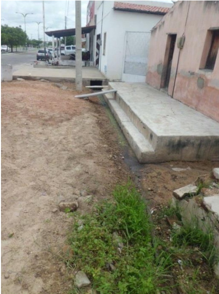
Figura 61: Vala negra com esgoto a céu aberto em logradouro da área urbana do município.
