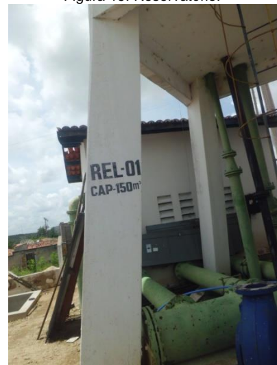
Figura 21: Reservatório Elevado REL.
