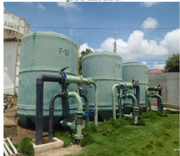
Figura 11: Estação de Tratamento de Água.
