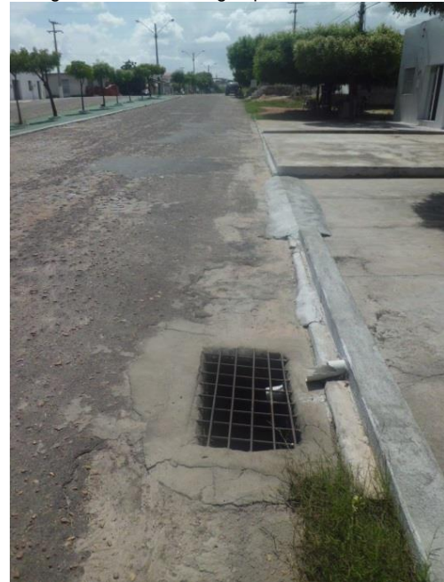
Figura 95: Boca de lobo com grelha em logradouro da área urbana do município.
