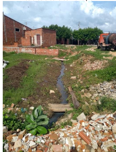
Figura 64: Vala negra com esgoto a céu aberto no bairro Nossa Senhora da Conceição da área urbana do município.
