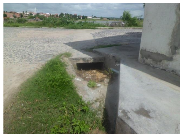
Figura 97: Boca de lobo em logradouro da área urbana do município.
