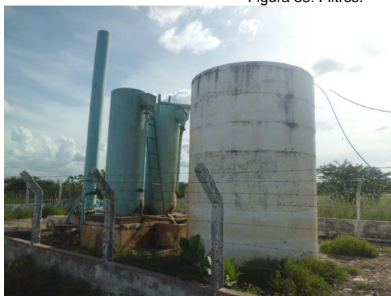
Figura 40: Vista da ETA.
