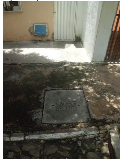
Figura 55: Caixa de passagem em passeio público no Distrito Sede.
