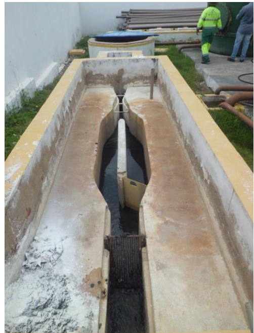
Figura 71: Tratamento preliminar do esgoto.
