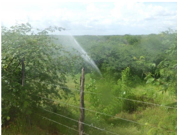
Figura 22: Rompimento adutora água bruta
