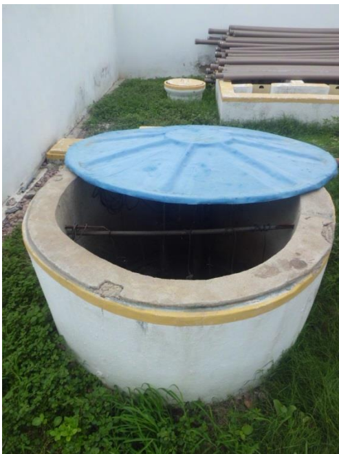
Figura 72: Poço de sucção da estação de elevatória de esgoto.
