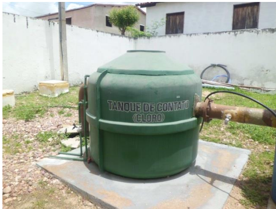
Figura 76: Tanque de cloração - ETE Jaguaratama.
