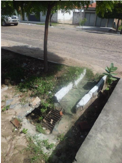
Figura 94: Boca de lobo com grelha em logradouro da área urbana do município.
