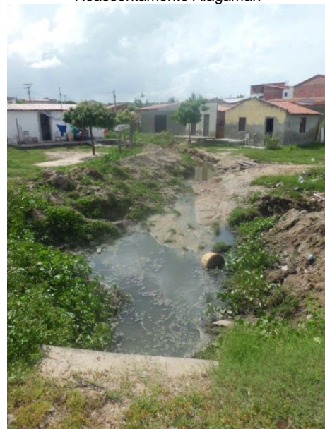
Figura 68: Vala negra com esgoto a céu aberto em logradouro da área urbana do município.
