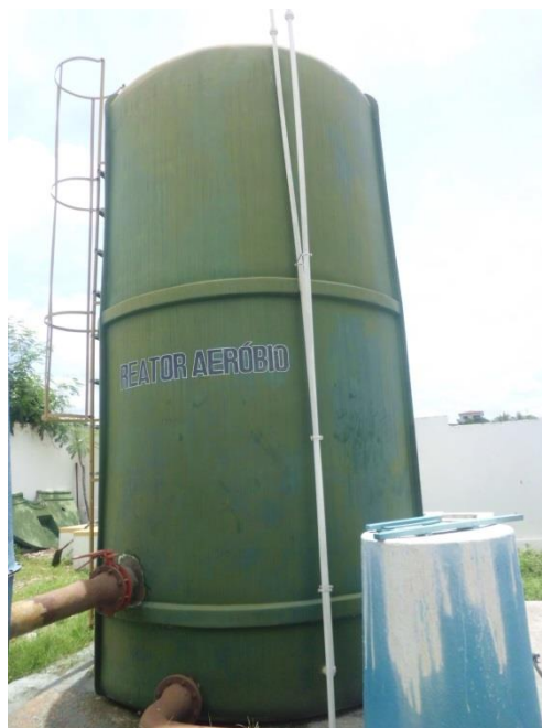
Figura 75: Reator aeróbio - ETE Jaguaratama.
