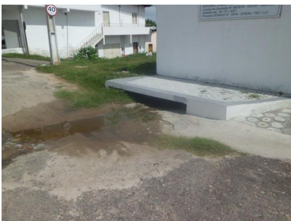
Figura 96: Boca de lobo em logradouro da área urbana do município.
