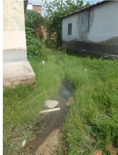
Figura 62: Vala negra com esgoto a céu aberto em logradouro da área urbana do município.
