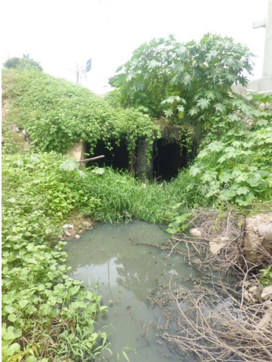
Figura 57: Canal com contribuição de esgoto no bairro Padre Sebastião Marleno.
