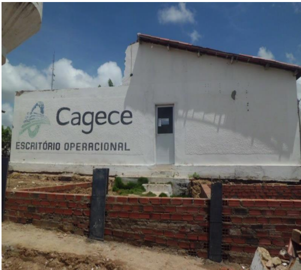
Figura 6: Entrada da ETA.
