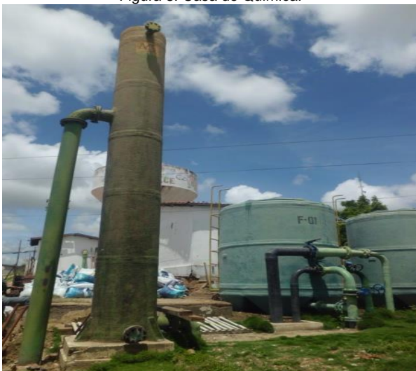
Figura 10: Estação de Tratamento de Água.
