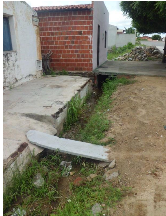
Figura 58: Vala negra com esgoto a céu aberto no bairro Padre Sebastião Marleno.
