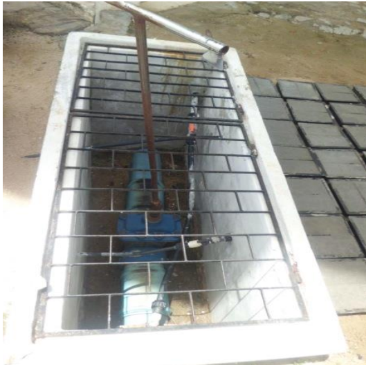
Figura 12: Caixa de Válvula.
