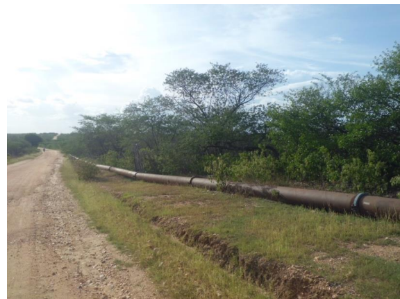
Figura 23: Adutora água bruta
