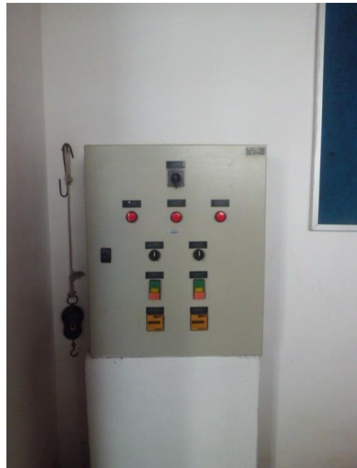
Figura 77: Quadro de comando da estação elevatória.
