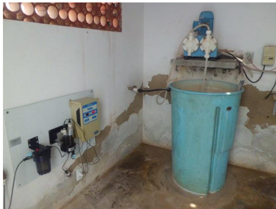
Figura 78: Sistema de preparação e dosagem de cloro - ETE Jaguaratama.
