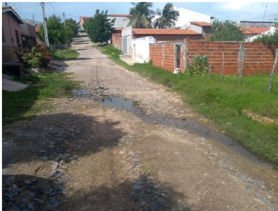
Figura 65: Vala negra com esgoto a céu aberto em logradouro do Distrito Sede.
