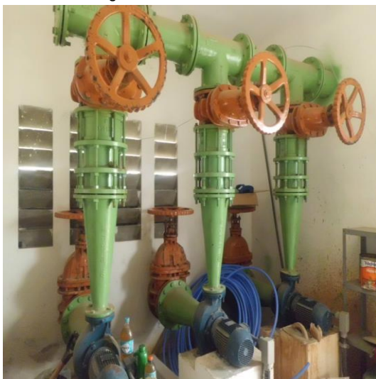
Figura 14: Barrilete da Elevatória.
