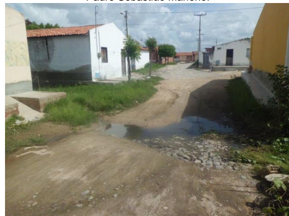
Figura 60: Vala negra com esgoto a céu aberto em logradouro da área urbana do município.
