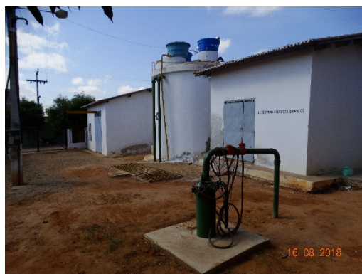
Figura 4.2 - Poço PT-01 – SSD de Porteiras
